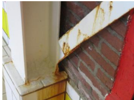
Lokale corrosiesporen op een windverband.
