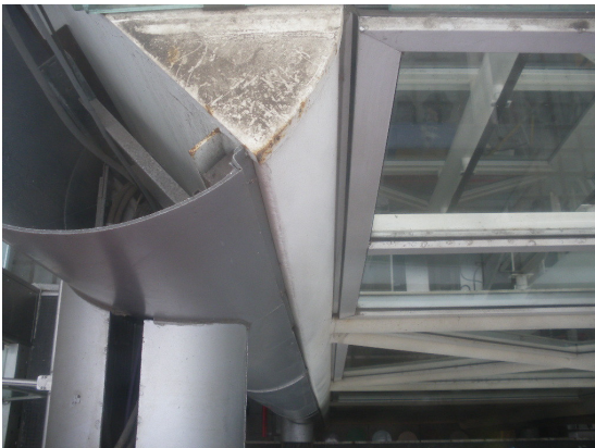
Corrosie op de lasnaad, ter plaatse van de half ronde kolommen van de liftconstructie.
