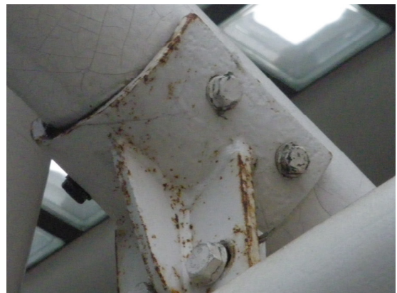
Corrosie op een koppelplaat.
