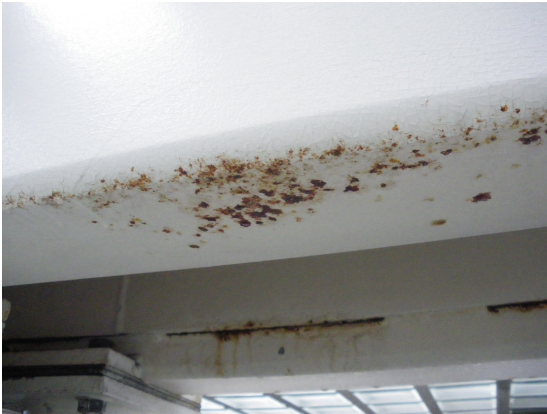
Oppervlakte corrosie op een stalen liggerconstructie.
