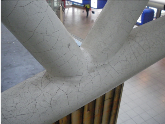
Craquelé in het verfsysteem op de buizen van de 2D en 3D liggerconstructies.
