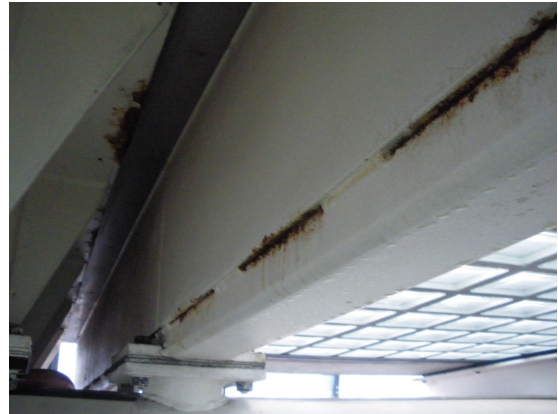
Spleetcorrosie op de aansluiting van twee stalen onderdelen, tussen de kettinglassen.
