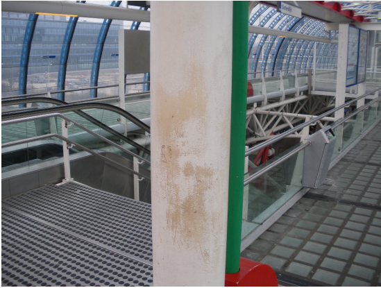
Mechanische verfschade op ronde kolommen tot 2.5 meter hoogte van het vloerniveau.
