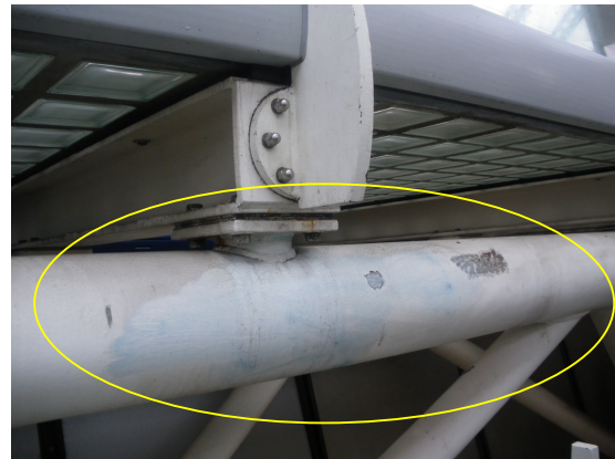
Kleine beschadigingen in de brandwerende coating van de 2D en 3D liggerconstructies.
