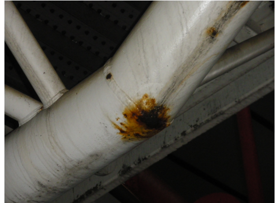
Corrosie in de knik van een 3D liggerconstructie.
