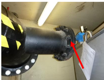
foto: pakking, hydrauliekruimte A west
