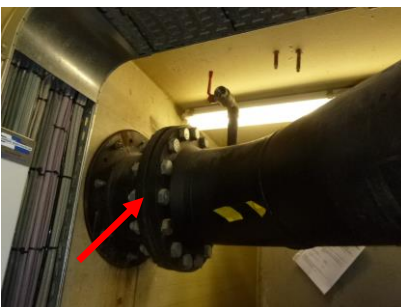
foto: pakking, hydrauliekruimte A west
