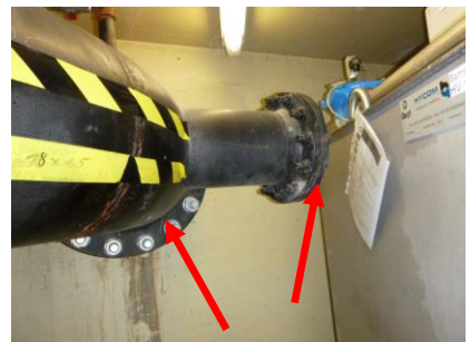
foto: pakking, hydrauliekruimte D oost
