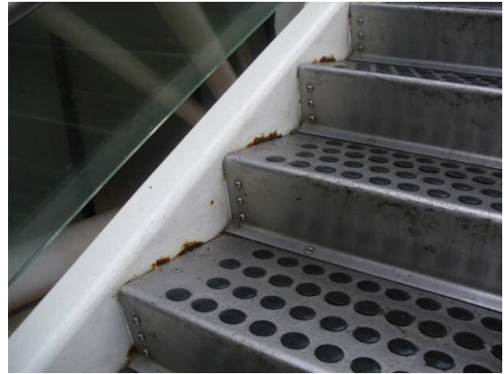
10. Corrosie aansluiting traptreden met -bomen.
