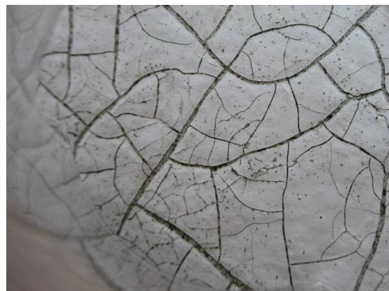
6. Sterk gecraqueleerd systeem kolommen e.d. passerelle (uitvergroting).
