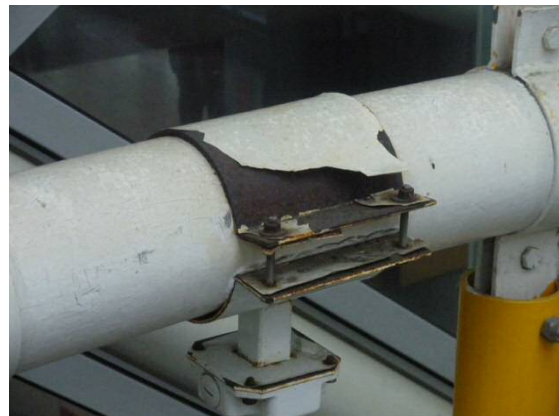
8. Onthechting en sterk gecorrodeerde beugels van o.a. camera's.
