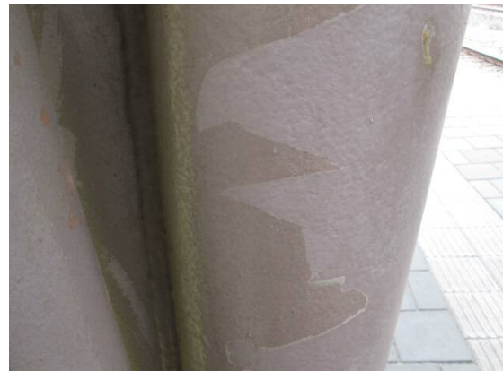
2. Onthechting blanke laag draagconstructie passerelle.
