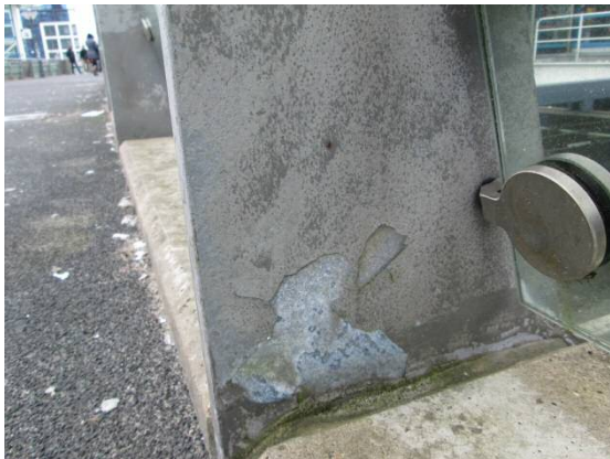
3. Plaatselijk onthechting verfsysteem.
