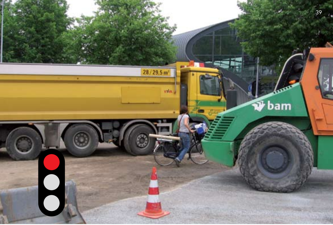
Geef duidelijk aan waar de fietsroutes lopen en voorkom fietsers tussen het werkverkeer.
