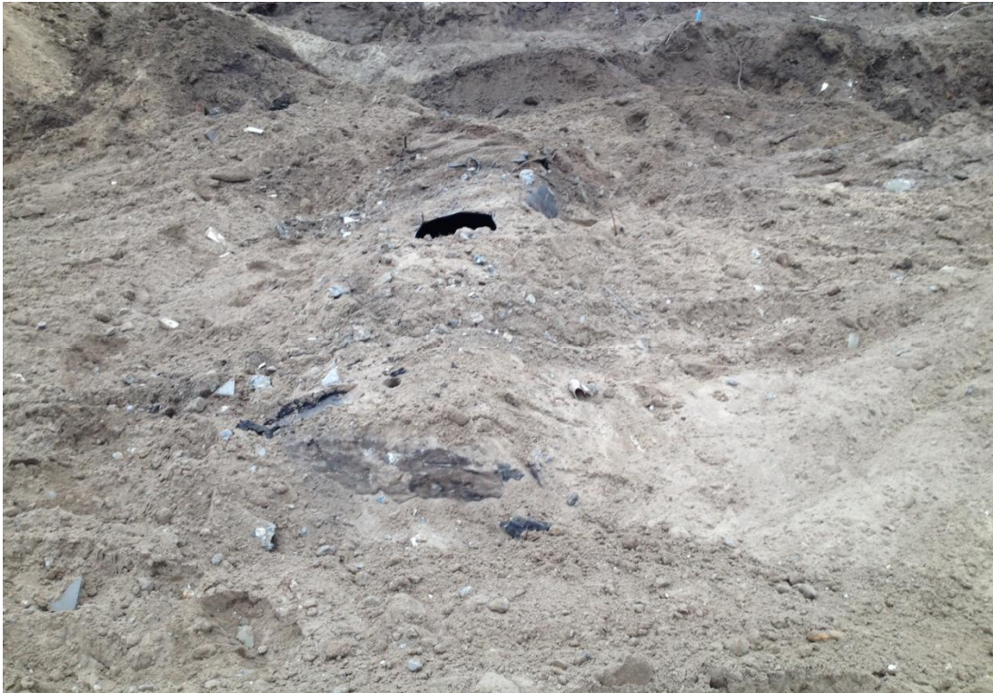
Foto van de 5 m 3 olietank, gelegen onder het gebouw van de voormalige Kapperschool. De olietank is ontdekt tijdens het slopen van de fundering buiten de saneringslocatie.
