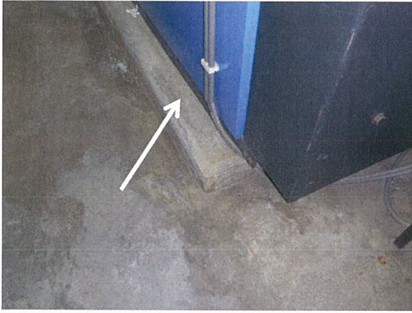
Foto 7: Gebouw R11: ruimtes achter vaste wand-, plafond- en vloerdelen geen onderzoek uitgevoerd.
