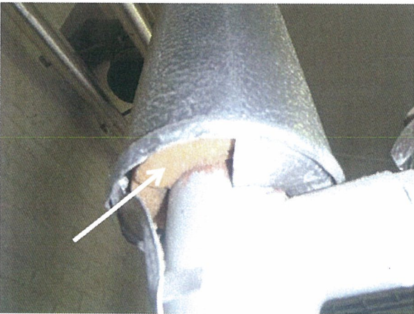
Foto 15: Gebouw AB: De leiding isolatie in de cv ruimte is van foam.
