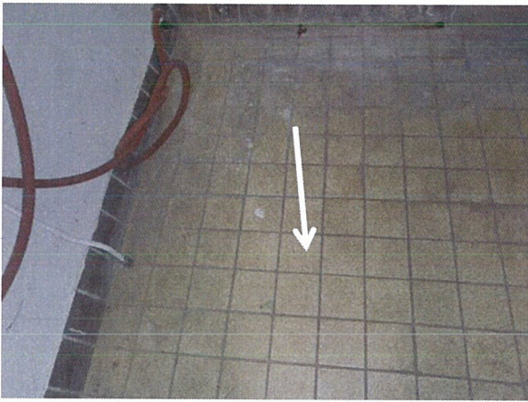
Foto 2: Gebouw HJ en HI: ruimtes achter vaste wand-, plafond- en vloerdelen geen onderzoek uitgevoerd.
