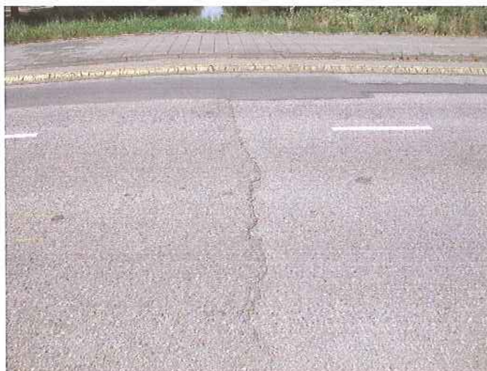
Foto 3 Overgang brugdek, plaatselijke verzakking
