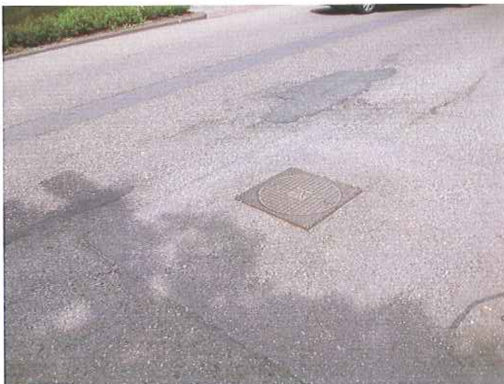
Foto 10 Reparaties en scheurvorming rond put.
