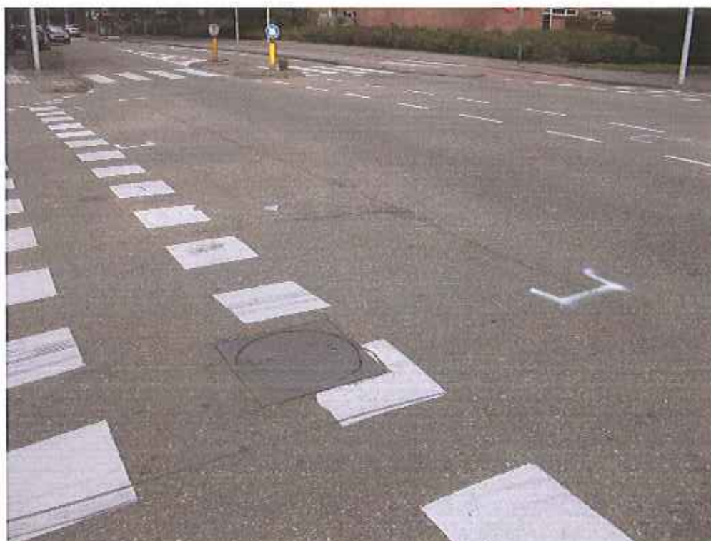
Foto 5 Kruising met Werengouw, diverse reparatievakken
