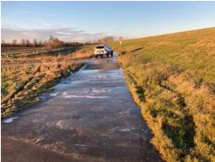
Figuur 2: Ijsvorming op fietspad Mariadijk
