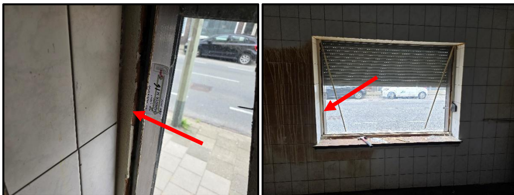
Bron 2/M16: asbesthoudende beglazingskit in gevelkozijn.
