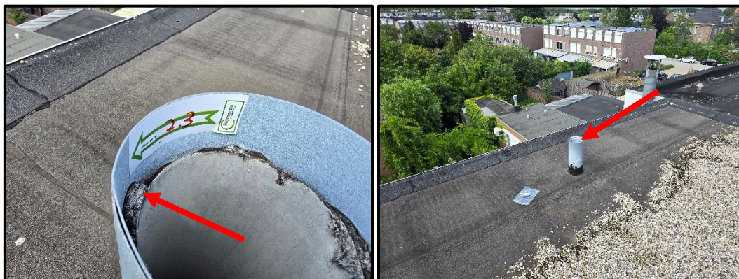
Bron 3/M2.3: asbesthoudend koord in schoorsteenpijpje hoofddak.
