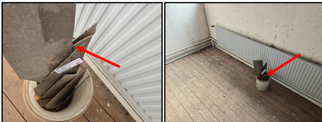
Bron 1/M3: losse stukken plaatmateriaal in emmer, asbesthoudend.
