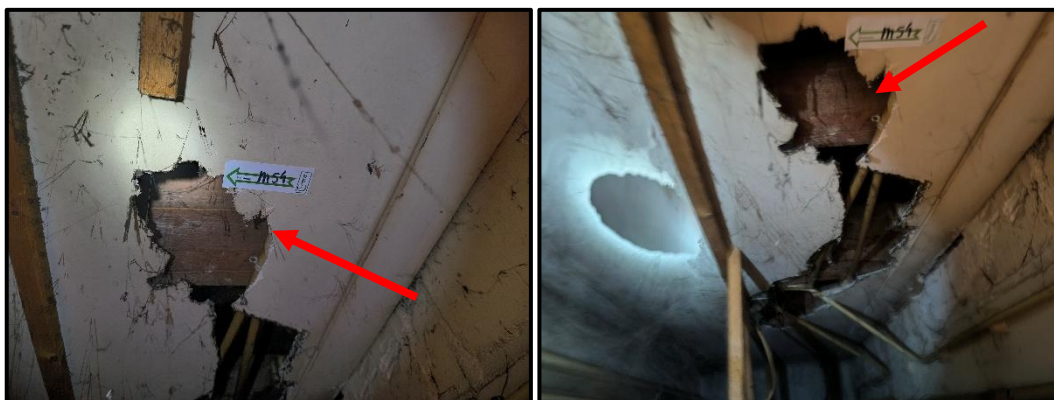
Bron 2/M54: asbesthoudend plaatmateriaal tegen het plafond van de keuken is niet-hechtgebonden.
