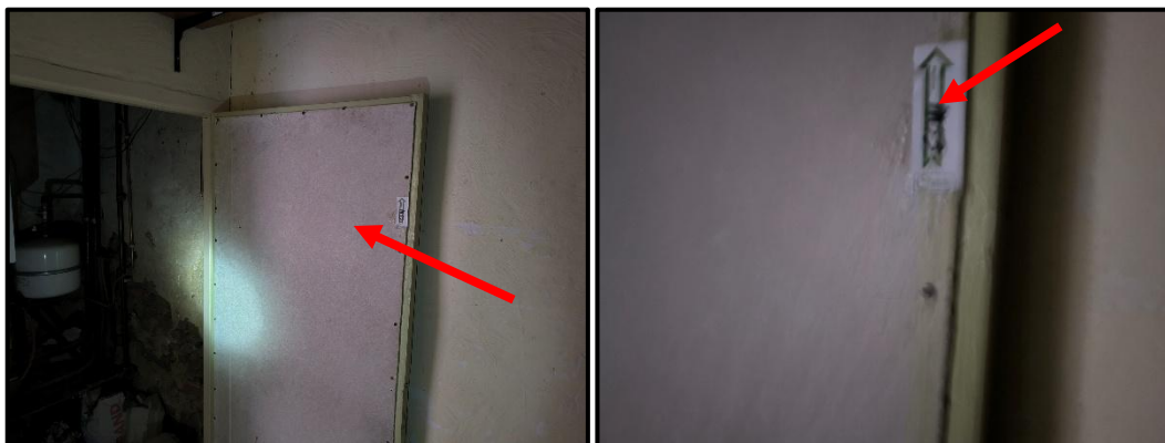
Bron 1/M53: plaatmateriaal op deur is asbesthoudend.
