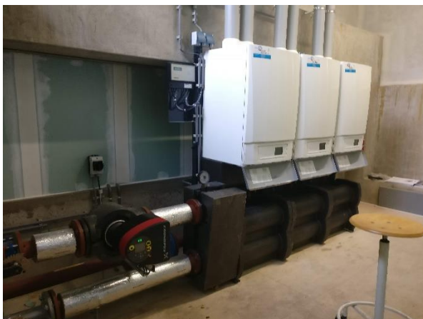
Cascadeopstelling op zolder Paleis
