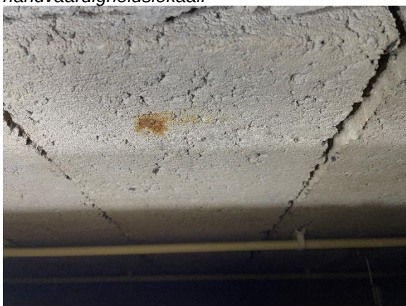
Afbeelding 4.5: bruine uitbloeding aangetroffen in een vulelement ter plaatse van methodieklokaal.
