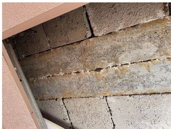
Afbeelding 4.6: kalkuitbloedingen ter plaatse van de entree onder de natte ruimtes.
