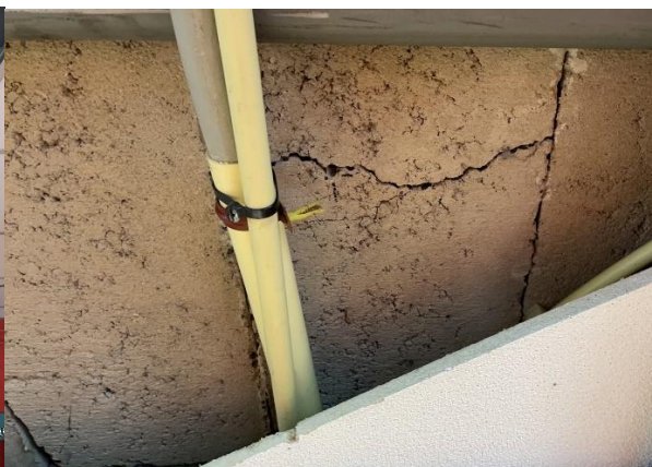
Afbeelding 4.8: scheur in vulelement ter plaatse van de entree.
