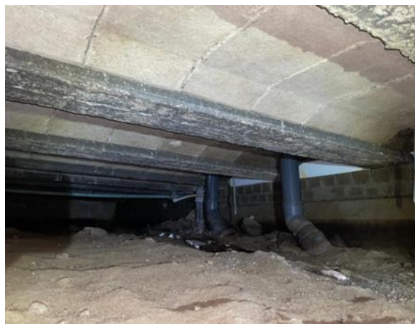
Afbeelding 4.6: kruipruimte met doorvoeren.
