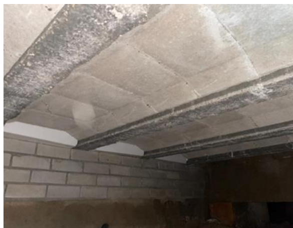
Afbeelding 4.4: geen schade aan Dato-vloer.
