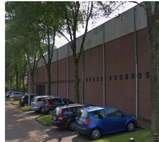
Figuur 2 Twee zaken zijn hier duidelijk misgegaan. Enerzijds is er geen variatie in locatie. Alle kasten hangen op dezelfde windrichting. Ten tweede is er geen variatie in type verblijfplaats (kleur, materiaal, constructie).
