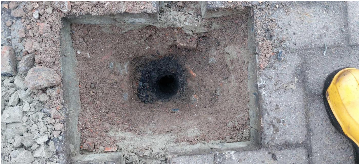
Foto 8: Foto asbestgat boring 28
