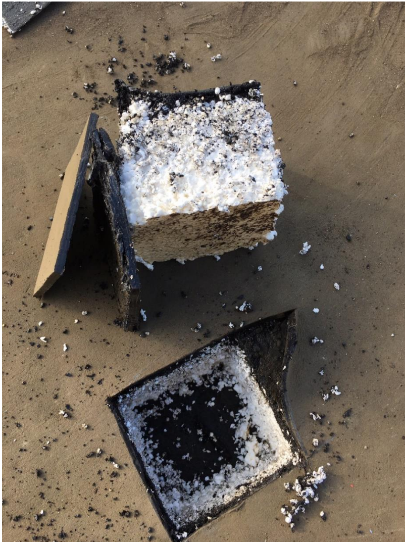
Condens/oude lekkage tussen de bitumenlagen
