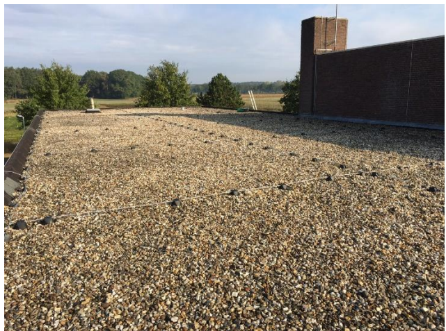
Dakranden craquelé vorming
