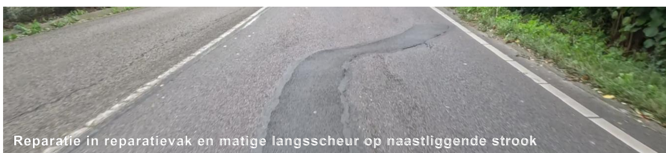
Reparatie en scheur in reparatievak
