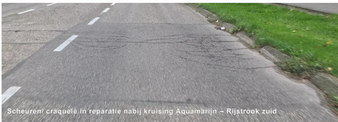
Reparatie in reparatievak en matige langsscheur op naastliggende strook
