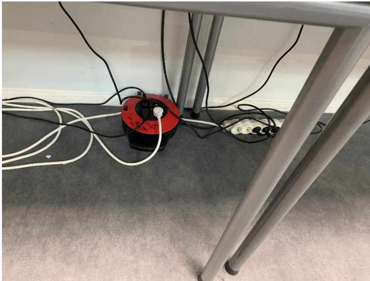
Foutief gebruik E-installatie
