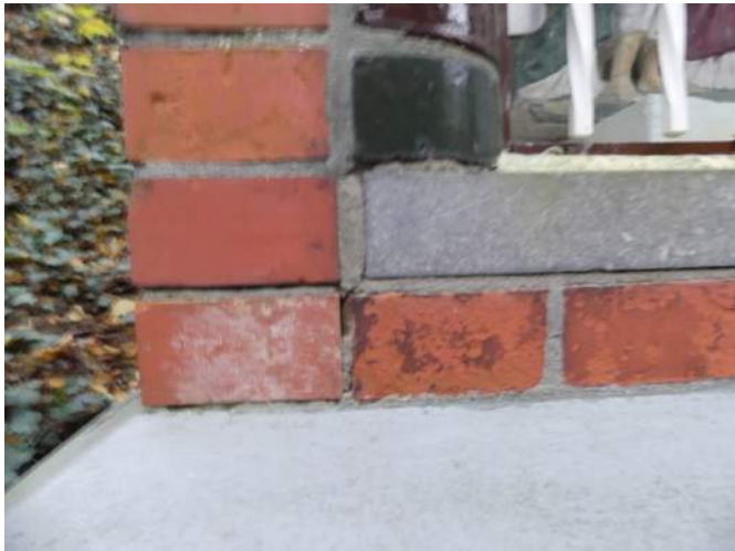
Afb. V.522.02, versleten, gescheurd en uitgevallen voegwerk
