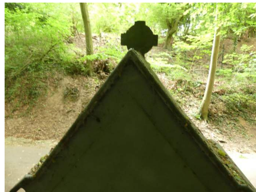
Afb. III.§35.02, beschadigd kruisje op dakje
