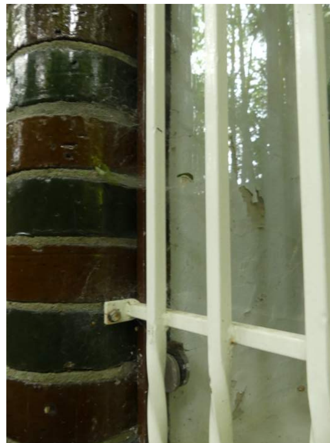
Afb. V.546.02, afbladderend sauswerk van pleisterwerk rondom stuc reliëf
