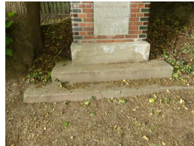
Afb. II.§21.01, beschadigd en slordig gerepareerd en gescheurd betonwerk van het basement
