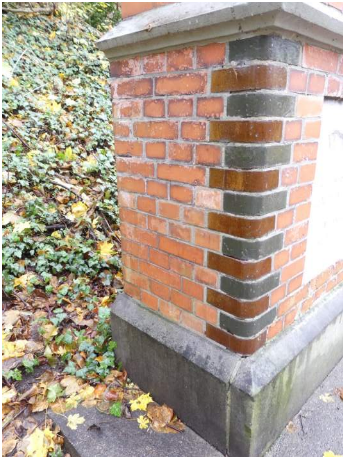
Afb. VI.522.01, afgeschilferde verblendstenen en uitgevallen voegwerk
