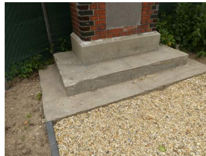
Afb. I.§21.01, uitgespoeld voegwerk en loszittend metselwerk
