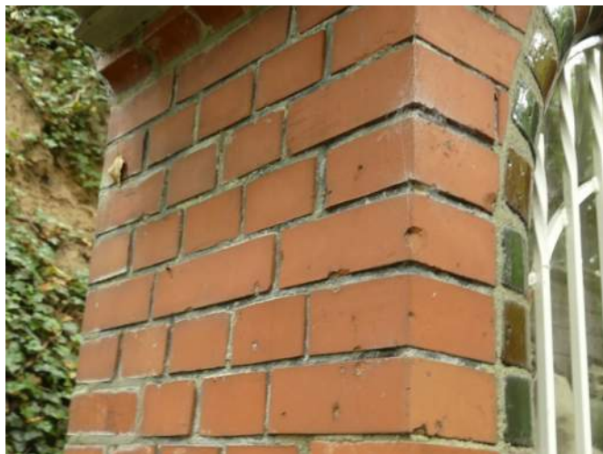
Afb. IV.§22.05, beschadigde verblendstenen, slordig hersteld voegwerk
