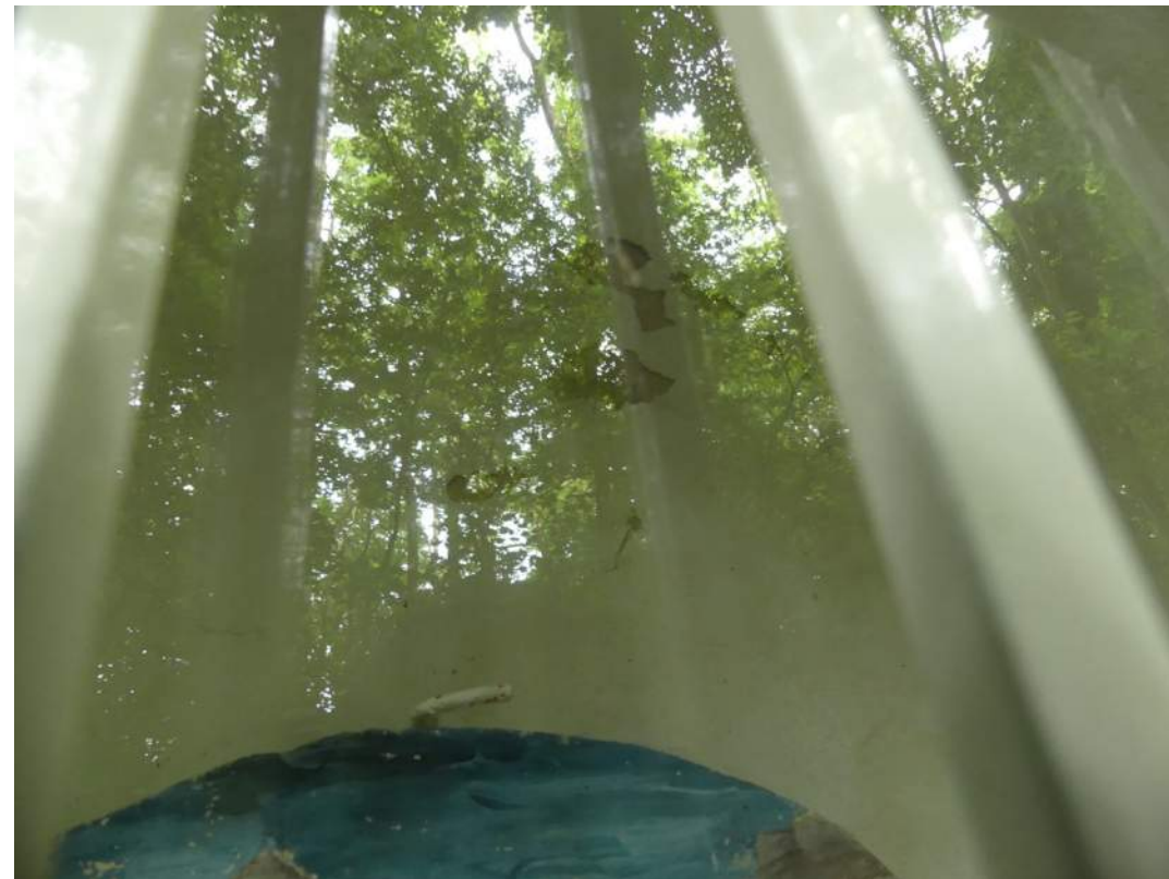
Afb. V.546.01, afbladderend sauswerk van pleisterwerk rondom stuc reliëf
