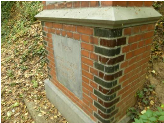
Afb. IV.522.02, uitbloei rondom profielstenen, craquelé in glazuur, gebroken profielstenen, slecht, te hard voegwerk
