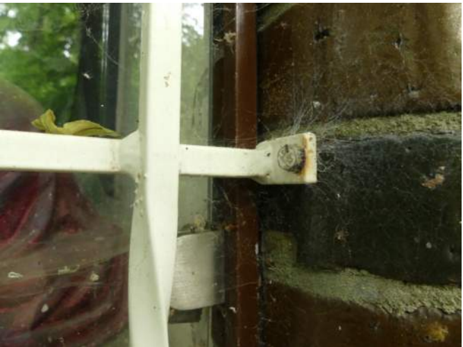
Afb. VI.543.01, roestvorming onder verflaag
