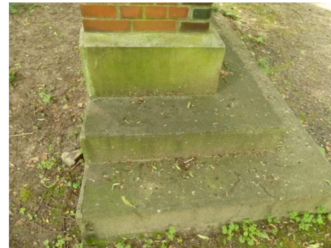
Afb. VII.§21.03, scheuren tussen basement en plintstrook en pleisterlaag achterzijde
