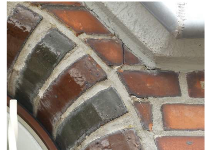
Afb. I.$22.04, kapotte verblendsteen en foutief herstel voegwerk
