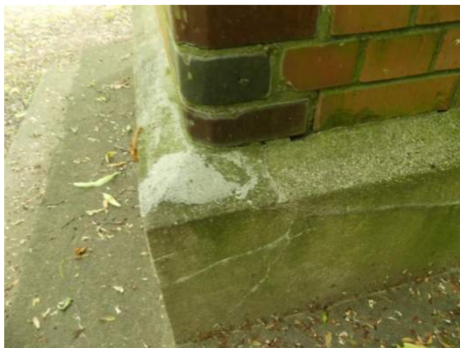
Afb. I.§22.03, beschadigde verblendstenen en uitgevallen voegwerk
