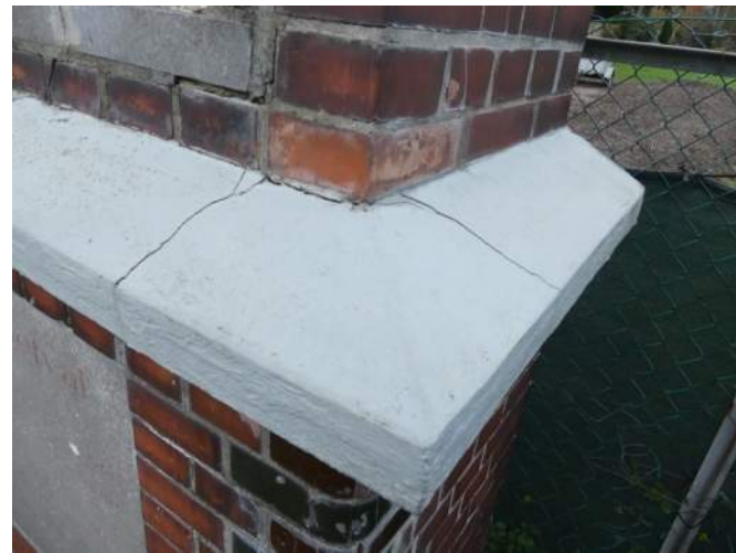
Afb. I.$21.04, scheuren in de betonnen waterlijst en uitgevallen voeg
