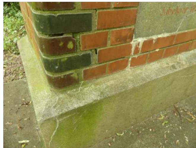
Afb. VII.§22.04, beschadigde profielstenen en uitgevallen voegwerk
