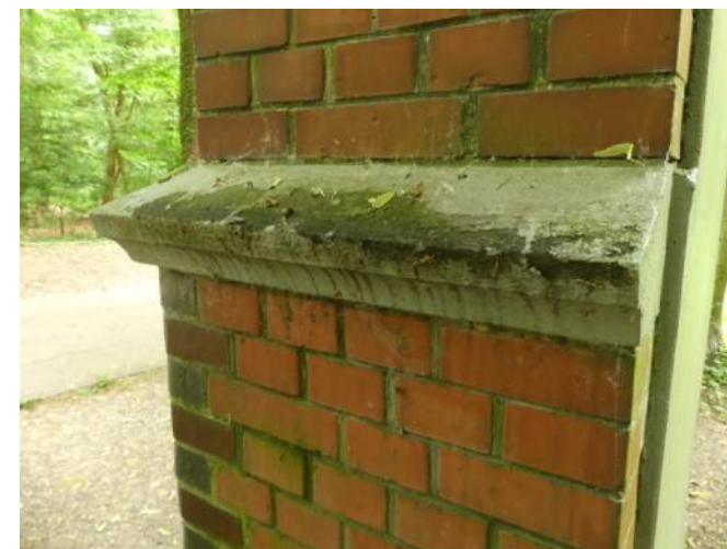
Afb. VII.§21.05, scheuren in de betonnen waterlijst
