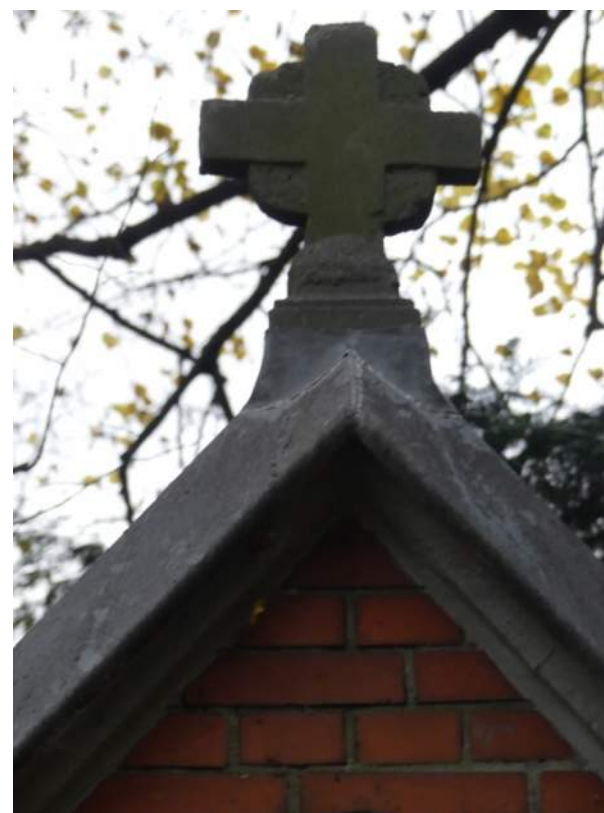
Afb. II.§35.03, beschadigd kruis op dakje
