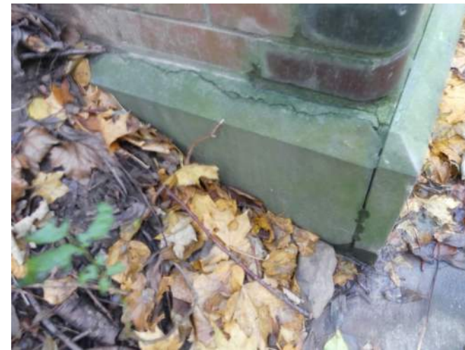
Afb. IV.§35.01, uitgevallen voegwerk hardsteen plintplaten
