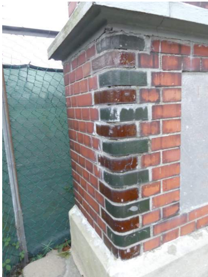
Afb. I.$22.01, veel uitbloei rondom de geglaazuurde profielstenen, craquelé in glazuur, barsten in profielstenen en loszittend en uitgevallen voegwerk
