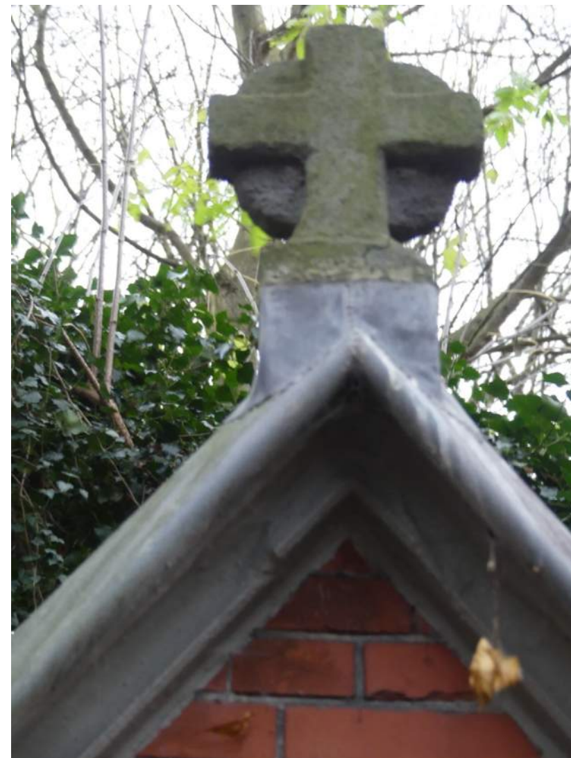
Afb. IV.§35.03, beschadigd kruisje op dakje
