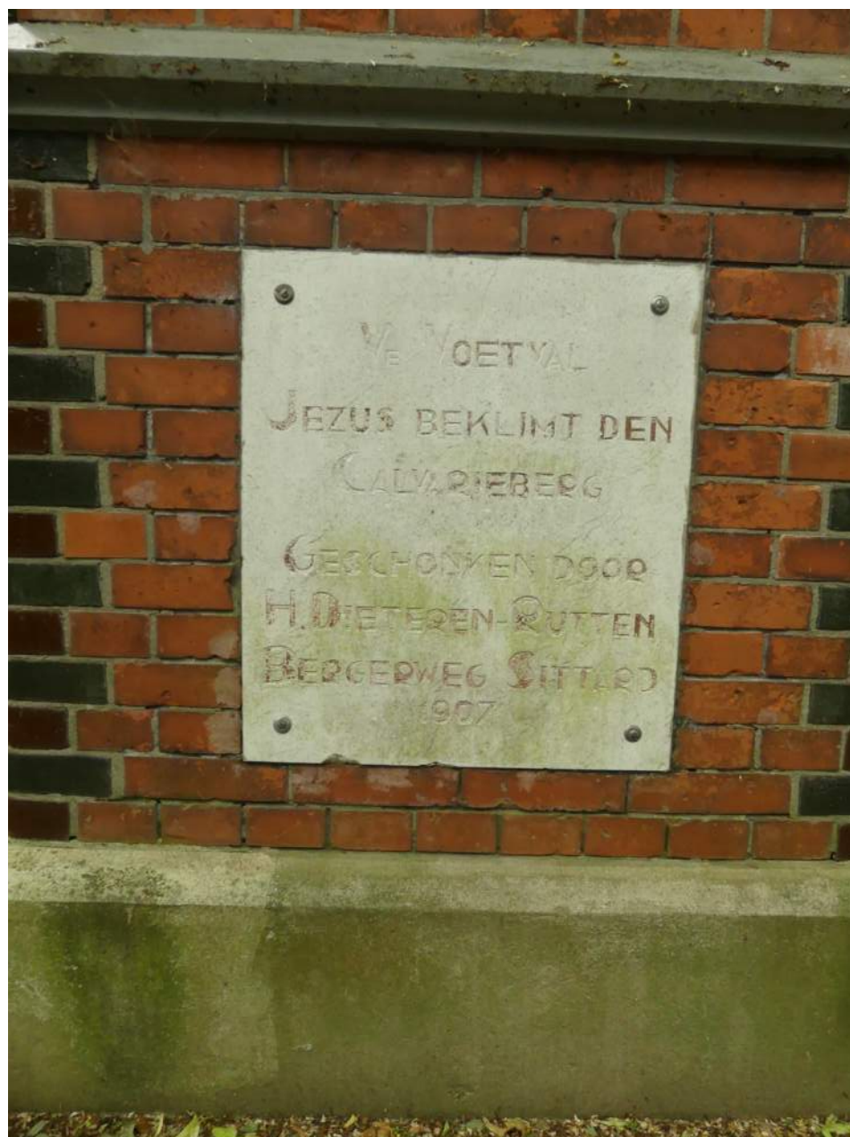
Afb. V.535.01, algaanslag op marmer(-achtige) gevelsteen en uitgesleten verf
