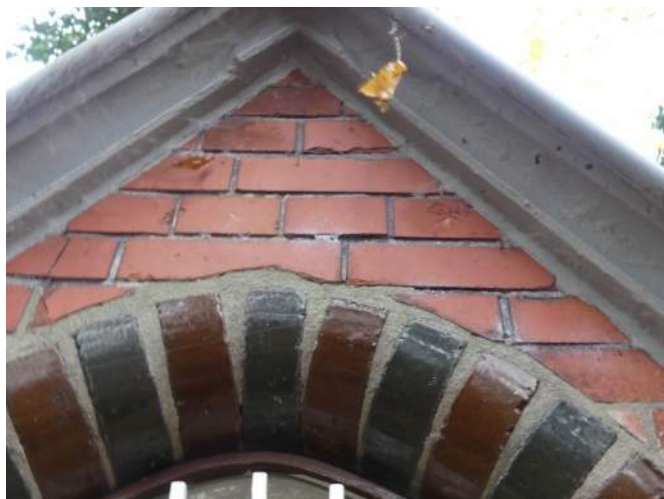
Afb. IV.§22.07, beschadigde verblendstenen, slordig hersteld en uitgespoeld voegwerk
