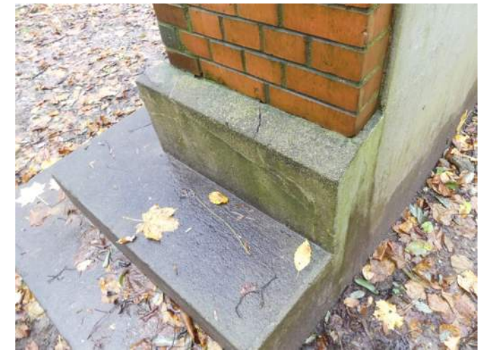
Afb. VII.§21.02, algaanslag en scheurvorming op plintstrook
