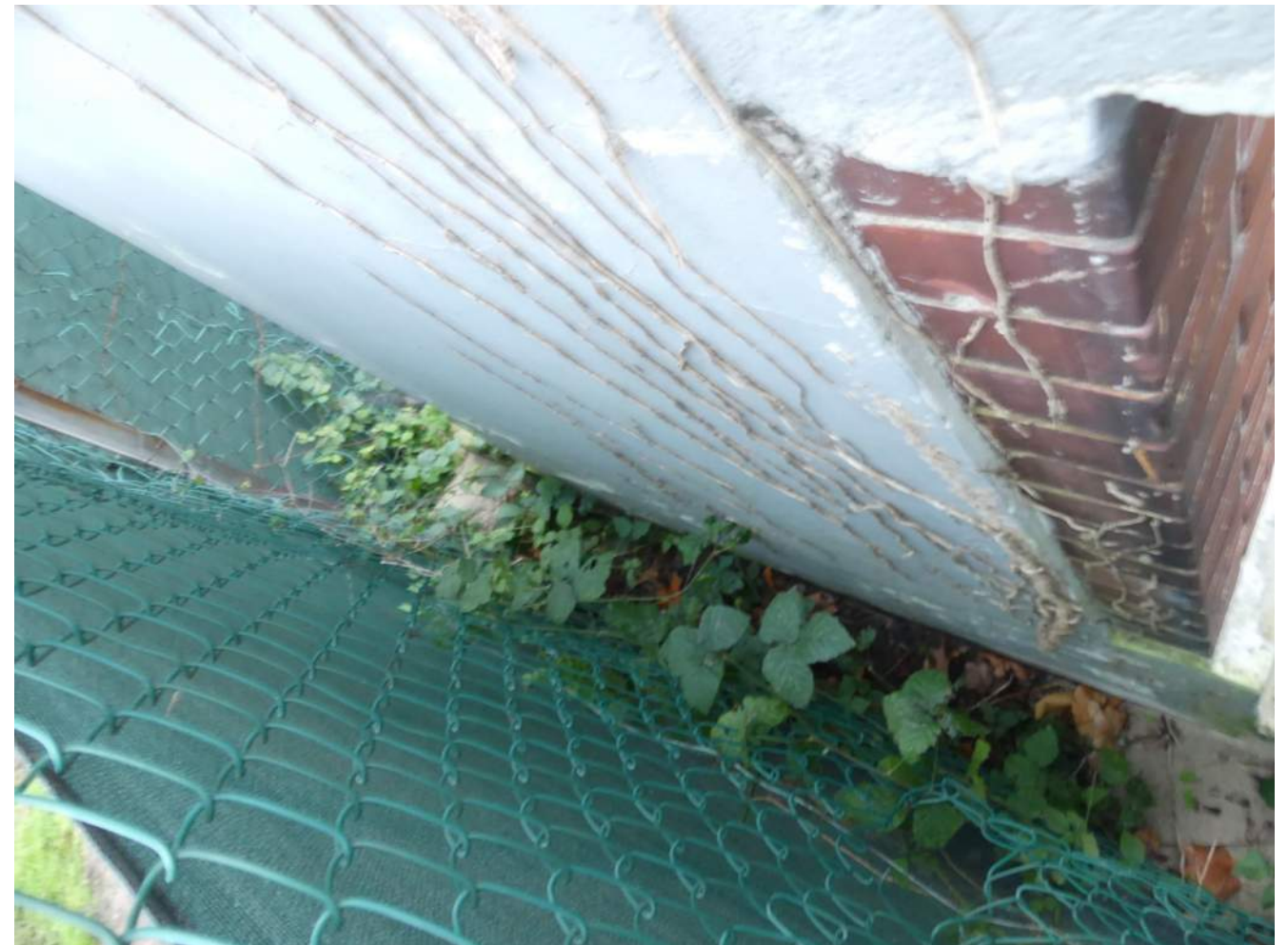
Afb. I.§12.01, te strak tegen de Voetval geplaatste omheining, hierdoor geen onderhoud mogelijk aan de achterzijde van de Voetval
