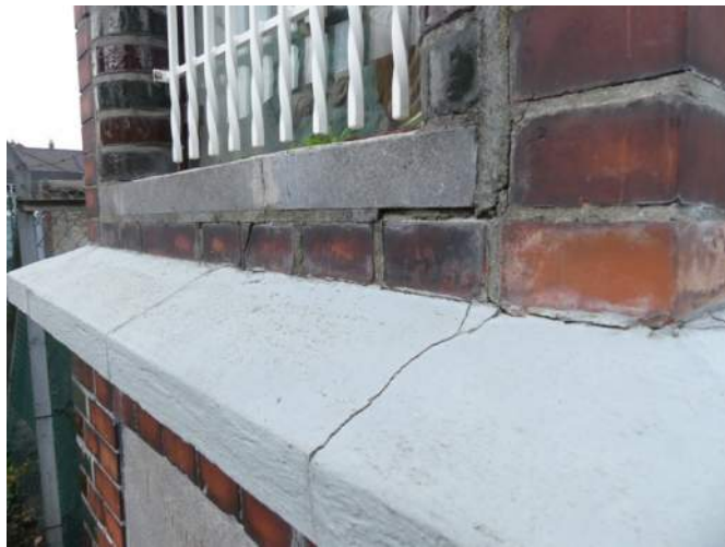
Afb. I.$21.03, scheuren in de betonnen waterlijst, in de hardsteen nisdorpel, de verblendstenen en het voegwerk
