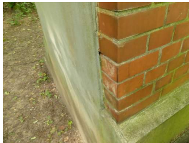
Afb. VII.§22.06, beschadigde verblendstenen en uitgevallen voegwerk
