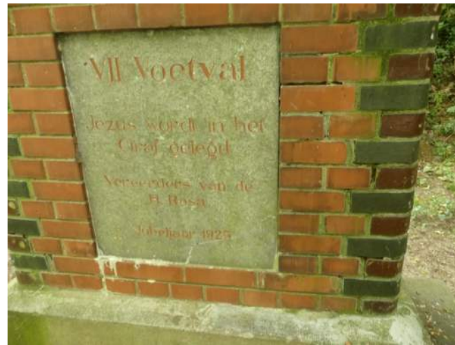
Afb. VII.§22.02, uitbloei onder gevelsteen en uitgevallen voegwerk
