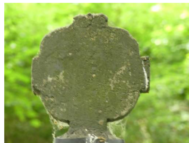
Afb. VI.§35.04, beschadigd kruisje op dakje
