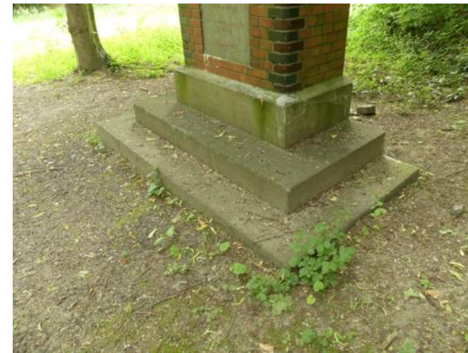
Afb. VII.§21.01, algaanslag op basement en beschadigingen op plintstrook
