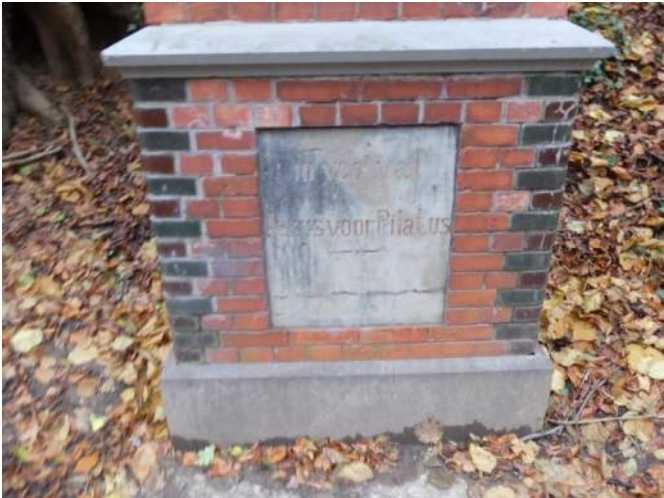
Afb. III.522.01, veel uitbloei en slecht hersteld voegwerk
