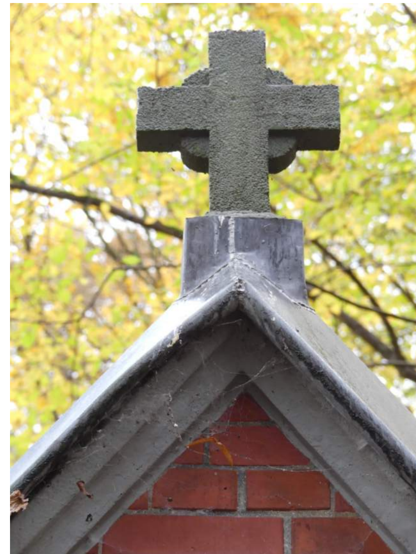
Afb. VII.§33.01, nok van zinkwerk ligt niet boven nok onderliggend werk
