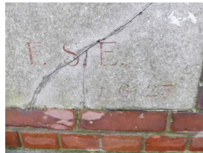
Afb. II.§35.02, detail scheurvorming in gevelsteen
