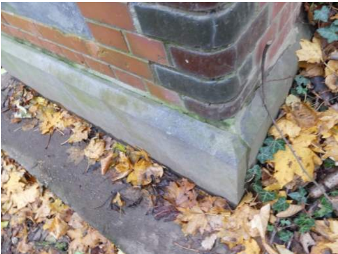
Afb. IV.522.03, slecht voegwerk natuursteen plint
