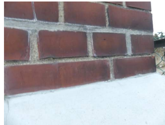
Afb. I.$22.03, gescheurde verblendsteen en foutief hersteld voegwerk
