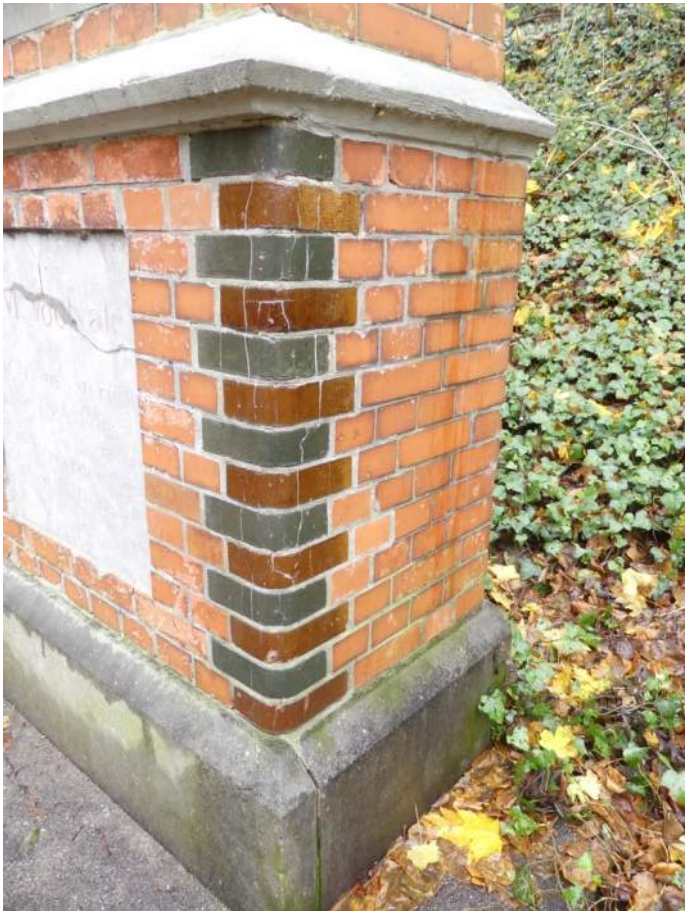
Afb. VI.522.02, gescheurde profielstenen, uitgevallen voegwerk en zeer slordig hersteld voegwerk (o.a. onder waterlijst)
