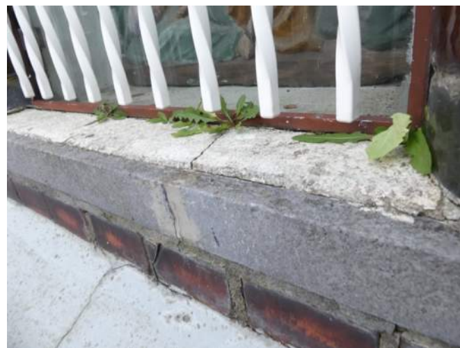
Afb. I.$35.01, losgescheurd afwaterend bedoeld pleisterlaagje
