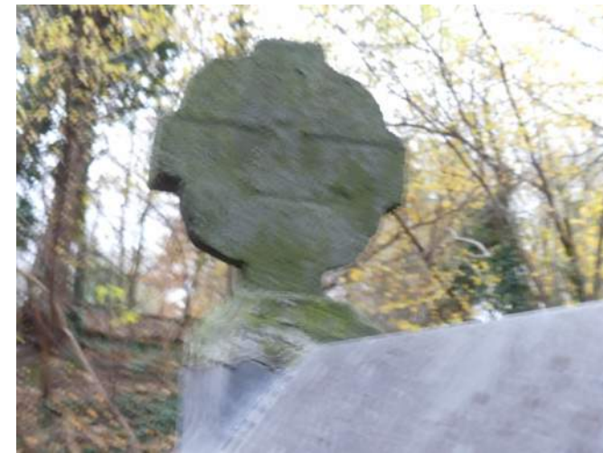
Afb. IV.§35.02, beschadigd kruisje op dakje
