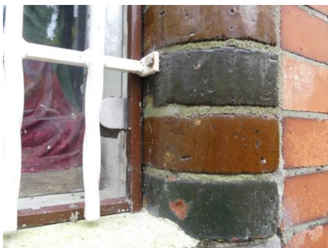
Afb. VI.§22.07, beschadigde profielstenen, slordig hersteld voegwerk
