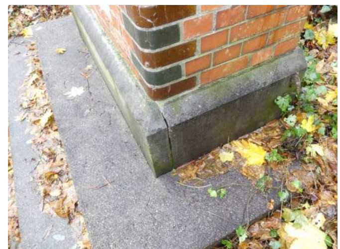
Afb. VI.§35.03, uitgespoeld voegwerk tussen plintplaten
