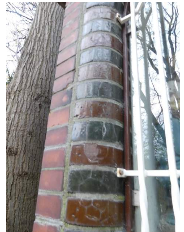
Afb. II.§22.02, beschadigde profielstenen, foutief hersteld voegwerk en roestvorming onder de verflaag
