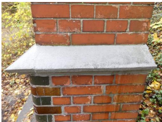
Afb. VI.§22.05, beschadigde verblendstenen en slordig hersteld voegwerk
