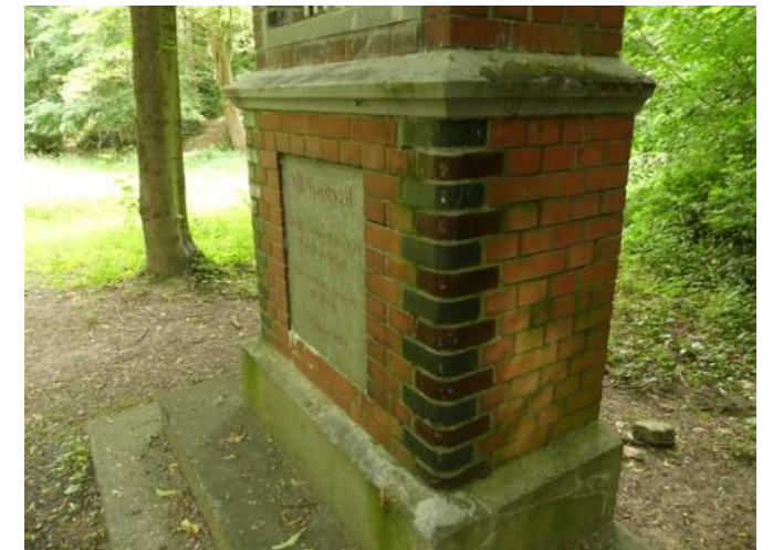
Afb. VII.§21.04, scheuren in de betonnen waterlijst
