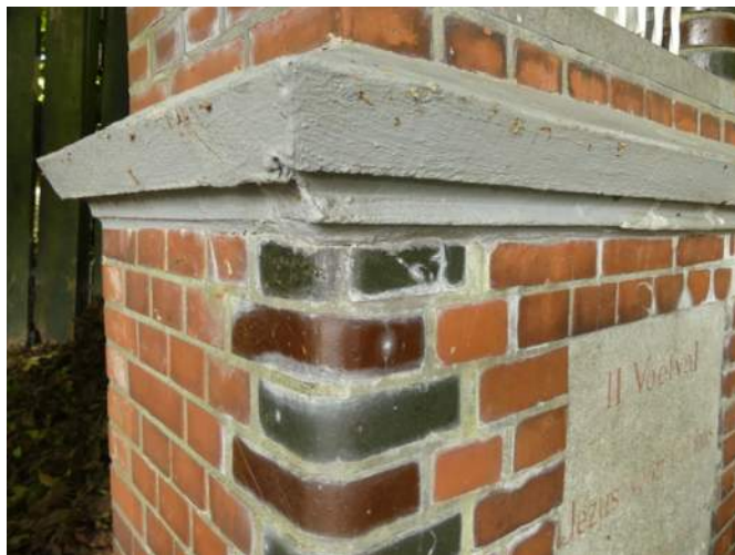
Afb. II.§22.03, uitbloei rondom profielstenen, beschadigde en kapotte profielstenen
