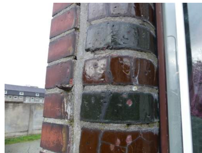
Afb. I.$22.05, beschadigde profielstenen en oud ijzer in de voegen (oude bevestiging vroegere gaashekwark)
