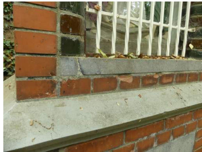
Afb. IV.§22.06, kapotte verblendstenen, gebroken hardsteen nisdorpel, onvoldoende diep hersteld voegwerk
