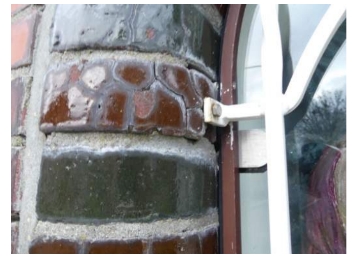
Afb. I.$22.06, kapotgebarsten geglaazuurde profielsteen
