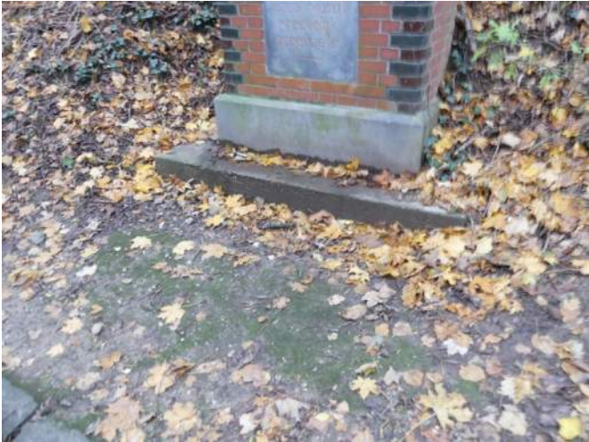
Afb. IV.512.01, grondprofiel dekt delen basement af, verzadigd basement, craquelé in glazuur
