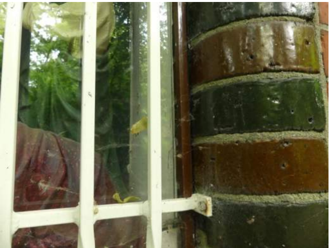
Afb. VI.543.01, afbladderende verf stucrelief2f
