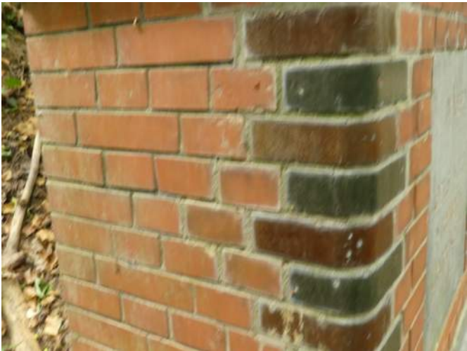
Afb. IV.522.01, uitbloei, beschadigde glazuur op profielsteen, uitgespoeld en weggevalen voegwerk
