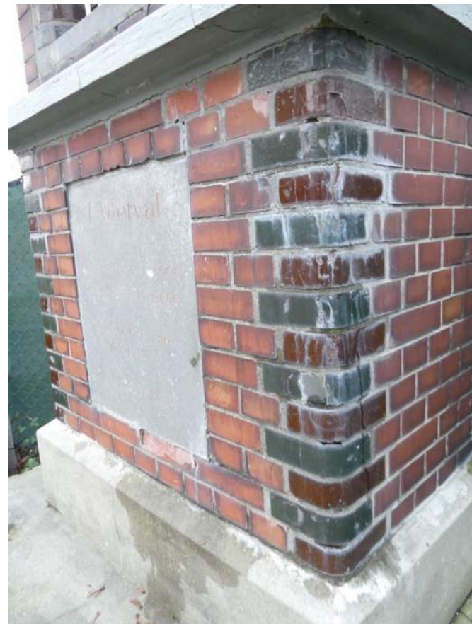
Afb. I.$22.02, veel uitbloei rondom geglaazuurde profielstenen, craquelé in glazuur, gescheurde en kapotte profielstenen, loszittend en uitgevallen voegwerk en afgeschilferde verblendsteen onder gevelsteen
