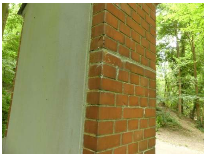
Afb. VII.§22.05, slordig hersteld voegwerk
