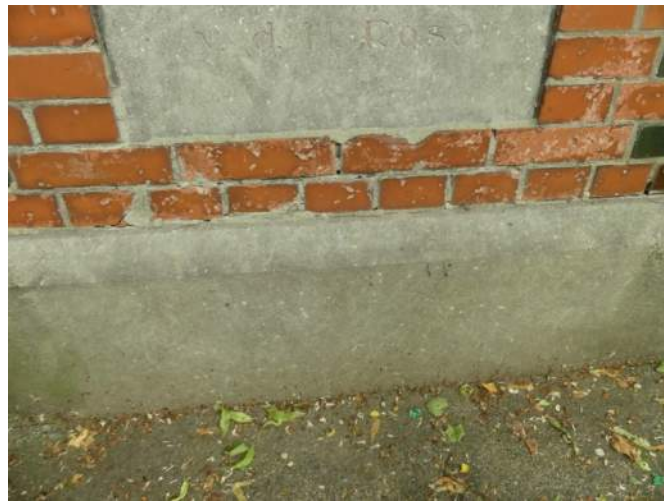
Afb. VI.§22.04, afschilferende verblendstenen en slordig hersteld en uitgevallen voegwerk
