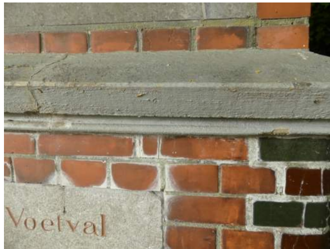
Afb. II.§22.04, veel uitbloei, gescheurde verblendsteen en foutief hersteld voegwerk
