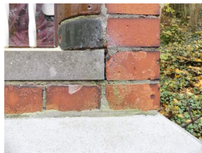
Afb. VI.§22.08, beschadigde verblendstenen, foutief hersteld en uitgevallen voegwerk
