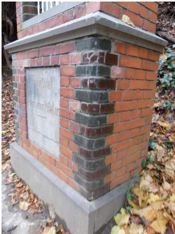
Afb. III.§22.03, uitbloei, gescheurde glazuur, beschadigde profielstenen en uitgevallen voegwerk
