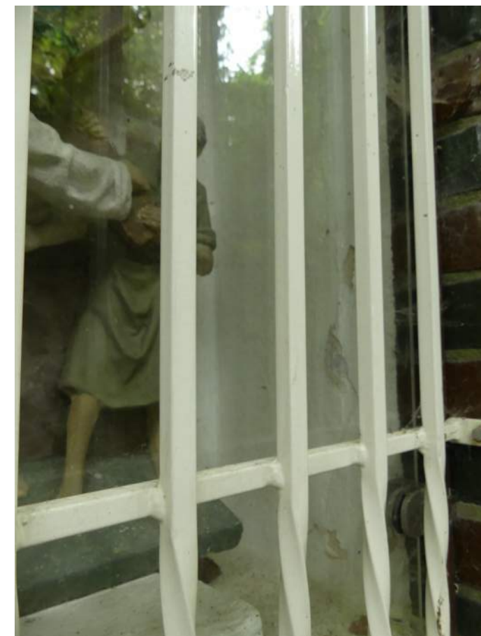
Afb. V.546.03, afbladderend sauswerk van pleisterwerk rondom stuc reliëf
