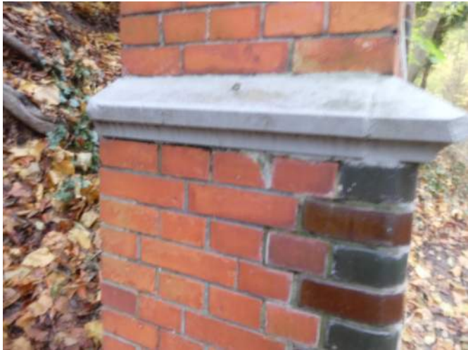
Afb. III.522.02, loszittend en uitgevallen voegwerk
