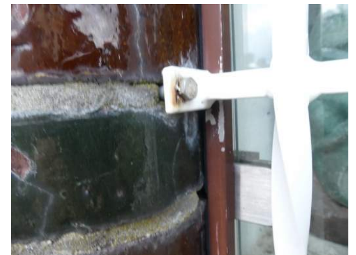
Afb. I.$43.01, roestvorming onder verflaag hekwerkje
