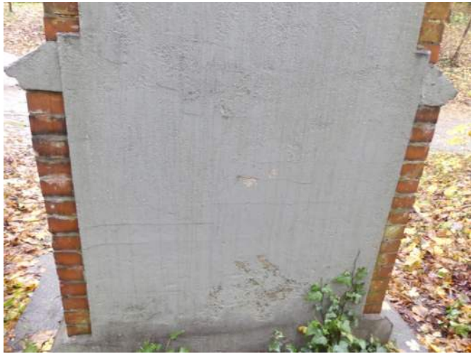
Afb. VI.540.01, gescheurd en afgeschilferd pleisterwerk achterzijde
