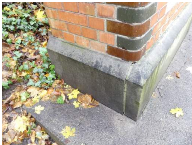
Afb. VI.§22.03, uitgevallen voegwerk tussen opgaand werk en hardsteen plintplaten
