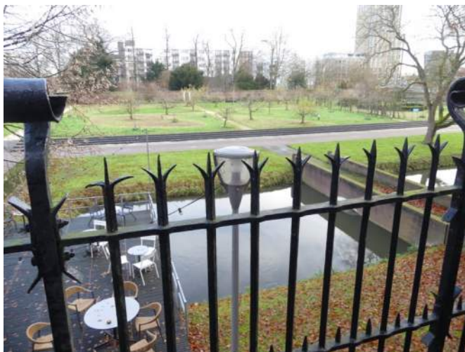
Afb. 04.43.19, verbogen en afgebroken hekwerkpunten
