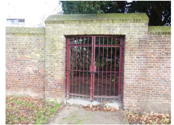
Afb. 04.43.22, te ruime poort: vleugels sluiten niet goed recht
