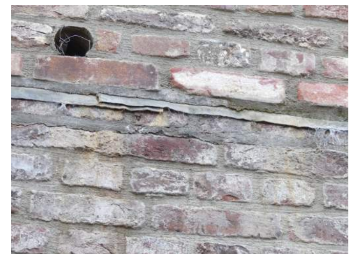
Afb. 04.22.22, losgescheurde voeg boven muurlood, ontbrekend felsrandje aan onderste loodstrook, slecht passend herstelwerk
