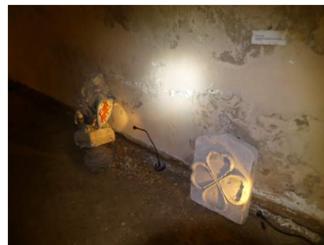
Afb. 12.40.11, beschadigd, afgevalen en verontreinigd pleisterwerk
