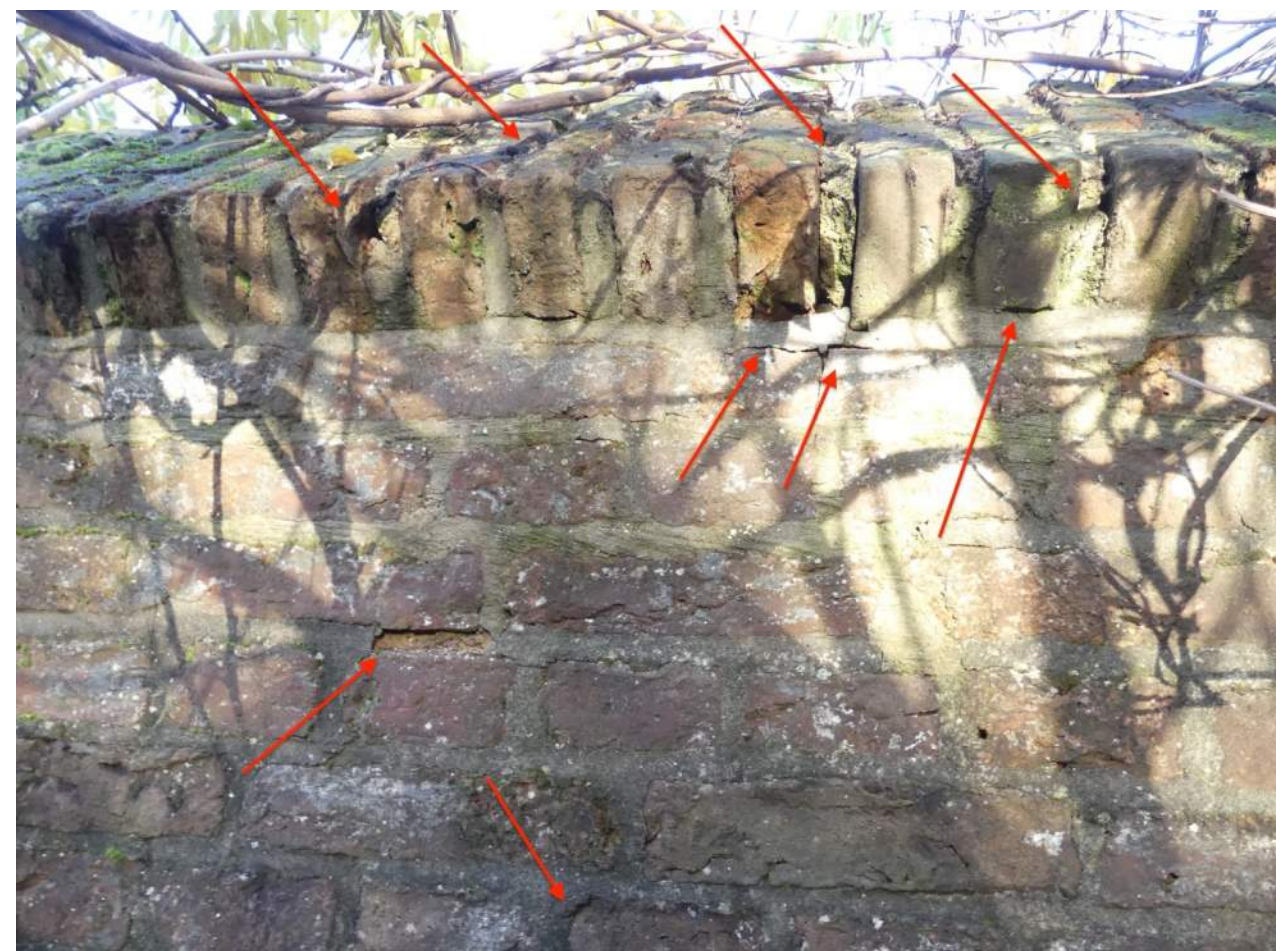
Afb. 06.22.22, te ondiep uitgehaald en weer uitgevallen voegwerk en versleten, losgescheurd voegwerk in de ezelsrug
