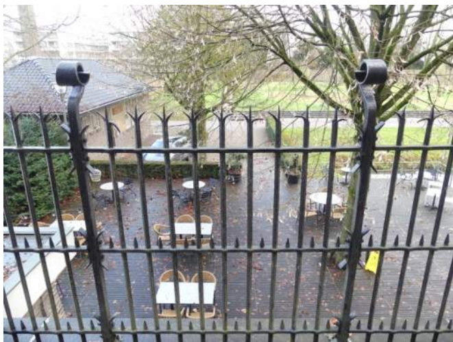
Afb. 04.43.17, verbogen en afgebroken hekwerkpunten
