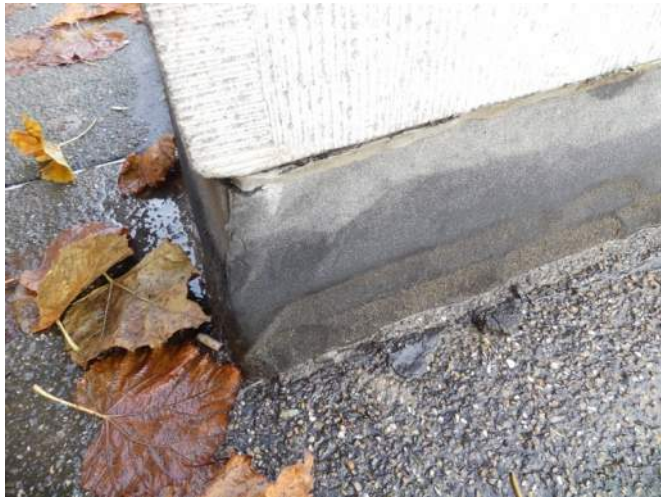
Afb. 04.35.29, losgekrompen kitvoeg tussen dakbedekking en afdek, daardoor een slechte, potentieel lekkende aansluiting
