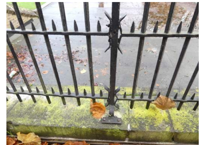
Afb. 04.43.02, vervormde hekwerkbeugels tegen baluster met diverse manieren van bevestigen en foutieve, slordig aangelast voetje met moderne moeren (met roestsporen!)
