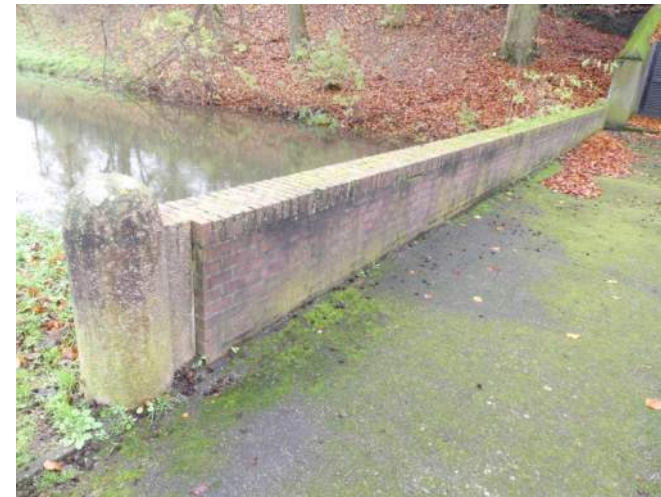
Afb. 04.22.33, alg- en mosgroei op voegwerk keermuren brug
