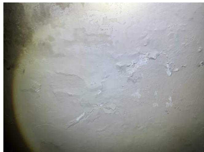
Afb. 12.40.04, beschadigd en afgebladderd gewelfpleisterwerk, enige uitbloei
