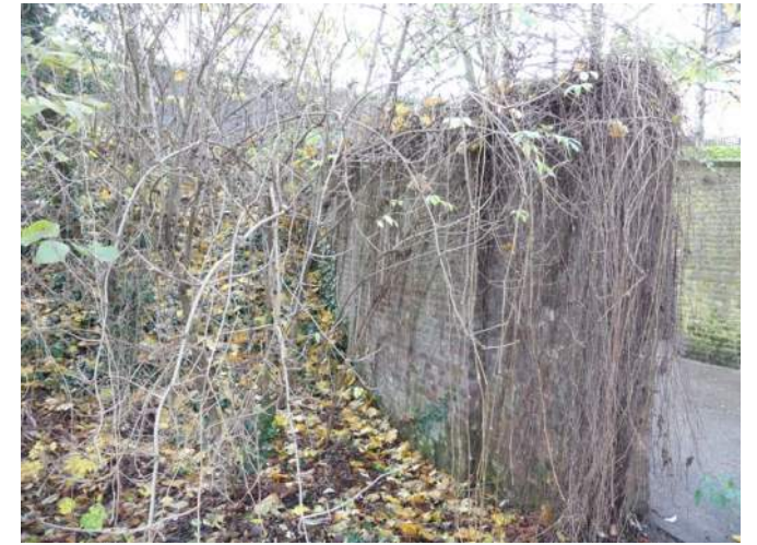
Afb. 05.22.60, volledig overgroeide muur
