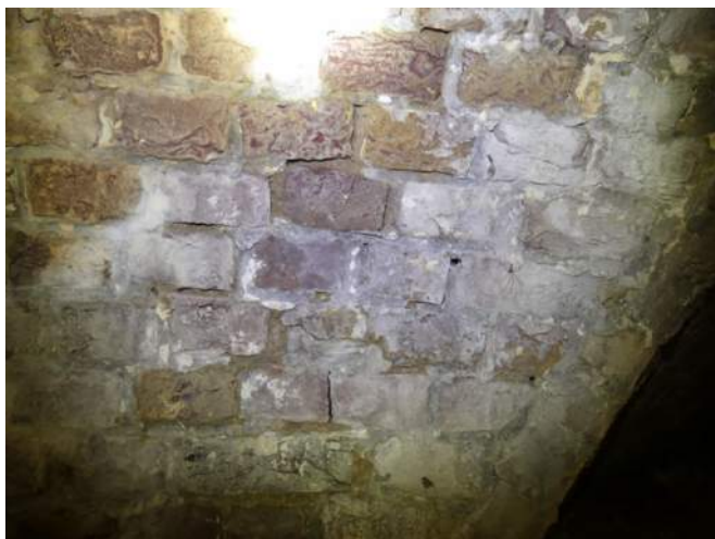
Afb. 12.22.23, verzandend- en uitgevallen gewelfvoegwerk
