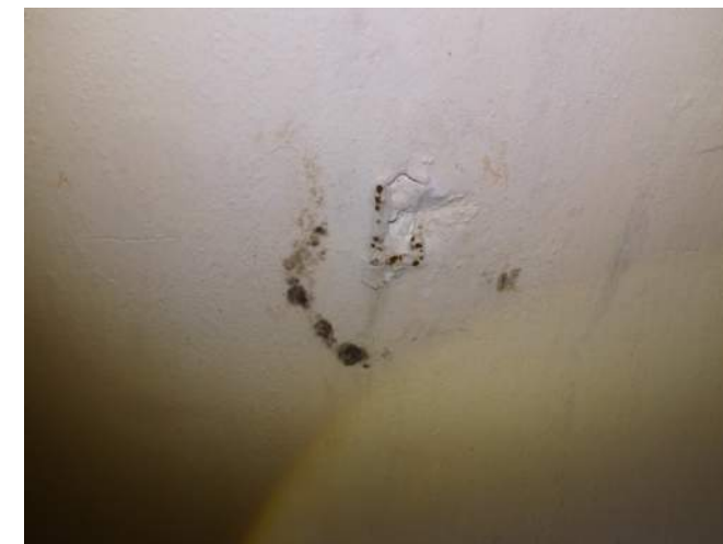
Afb. 12.40.08, roestend ijzerwerk en vervuild pleisterwerk
