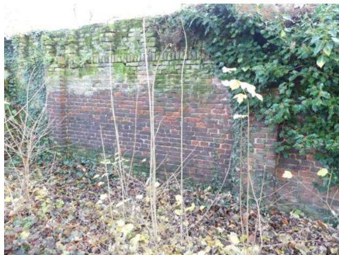
Afb. 05.22.44, uitgespoeld voegwerk en losliggend metselwerk, enkele detonerende reparaties
