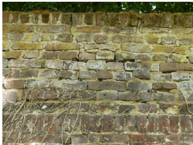
Afb. 11.22.06, gescheurd metselwerk, losliggende stenen en uitgevallen voegwerk
