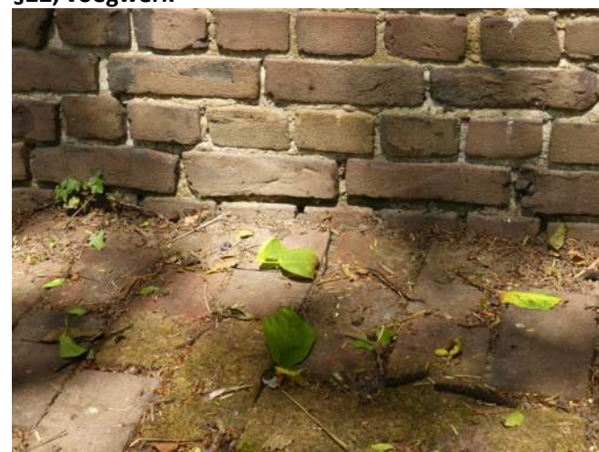
Afb. 11.22.11, diep uitgespoeld voegwerk bij maaiveld
