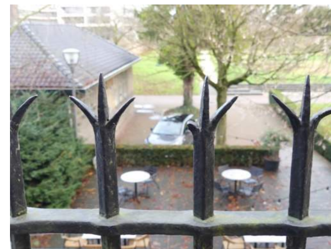
Afb. 04.43.13, verbogen en afgebroken hekwerkpunten
