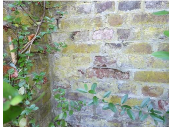
Afb. 06.22.01, vochtige stenen in hersteld, droog (te hard) voegwerk
