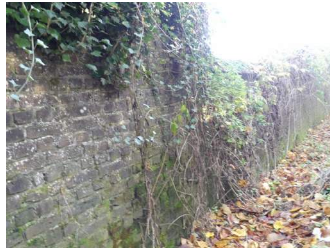
Afb. 06.22.34, volledig met begroeiing vervuilde muur
