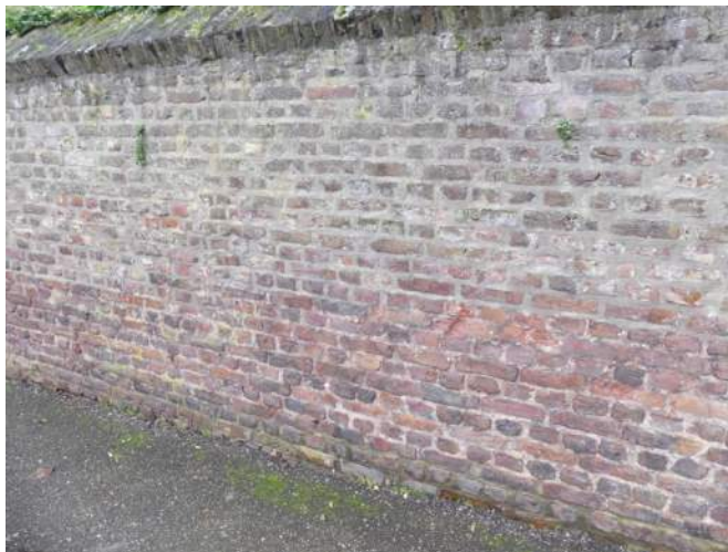
Afb. 10.22.03, afschilferende stenen en uitgespoeld voegwerk bij maaiveld
