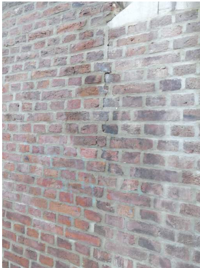
Afb. 05.22.03, gescheurd metselwerk bij verspringing
