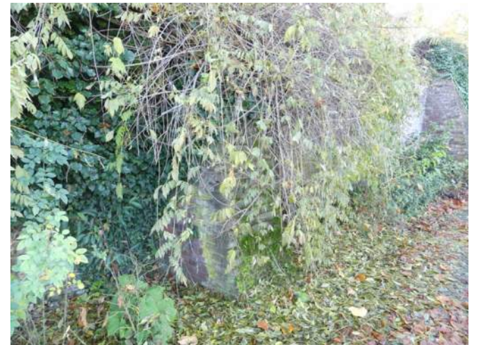
Afb. 06.22.33, volledig met begroeiing vervuilde muur
