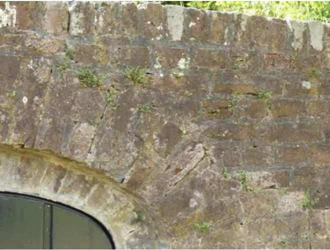
Afb. 12.22.13, gescheurd voegwerk met inwortelende vegetatie en alggroei
