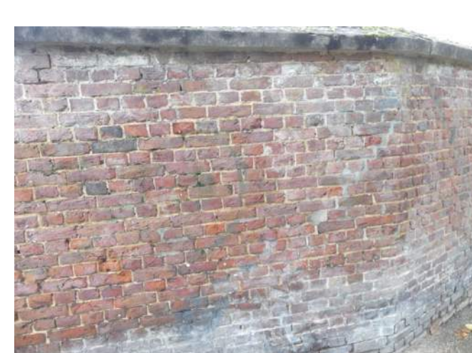
Afb. 08.22.17, uitgesleten voegwerk en foutieve reparaties
