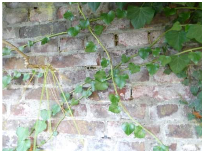
Afb. 06.22.12, foutief hersteld, weer loszittend en uitgevallen, voegwerk
