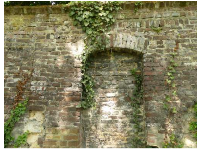
Afb. 11.22.07, gescheurd metselwerk en begroeiing
