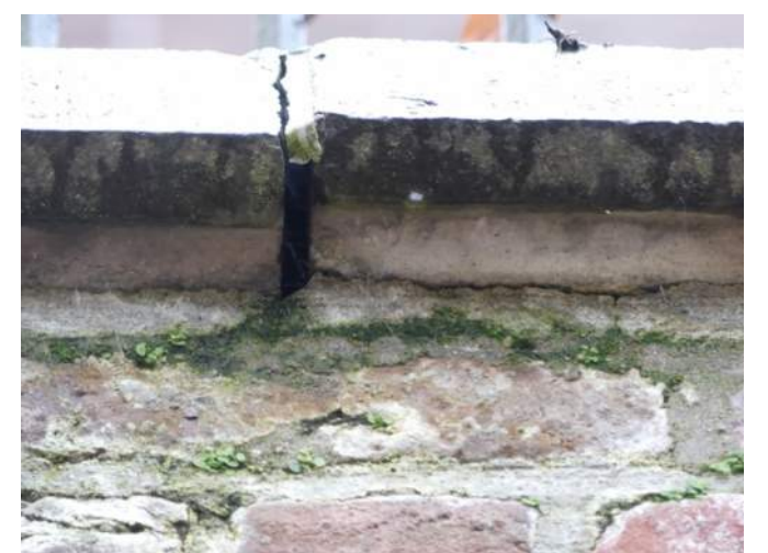
Afb. 04.35.28, detail gevolgschade: alg- en mosgroei en lekkage
