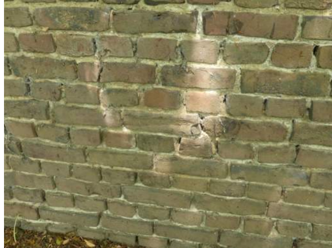
Afb. 11.22.02, kapotte stenen en uitgesleten voegwerk
