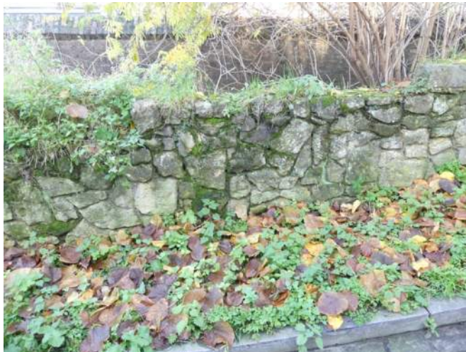
Afb. 07.35.22, met alg en mos begroeide voegen en uitgevallen voegwerk
