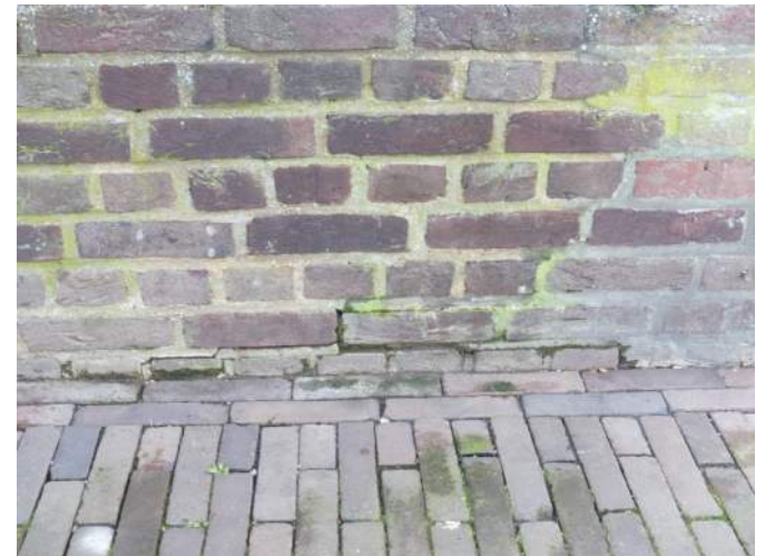
Afb. 06.22.06, uitgespoeld voegwerk bij maaiveld
