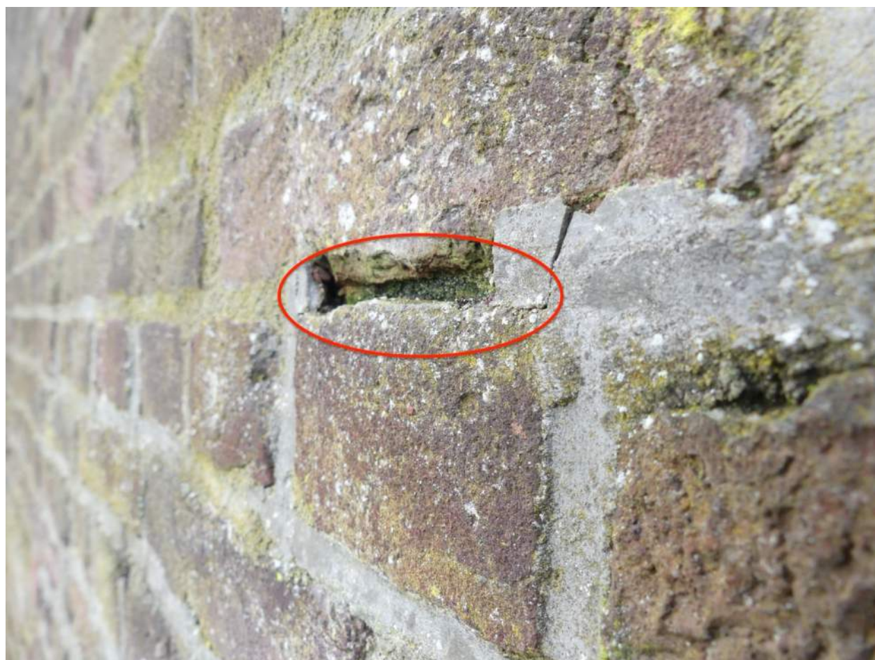
Afb. 04.22.47, volstrekt onvoldoende diep uitgehaald voegwerk (met alg begroeid!!) en -dus maar ook door het uiterlijk- slechte reparaties
