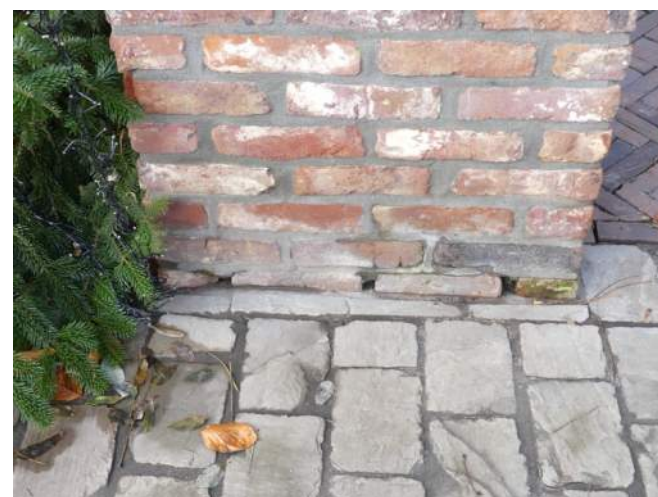
Afb. 05.22.52, uitgespoeld voegwerk boven straatwerk
