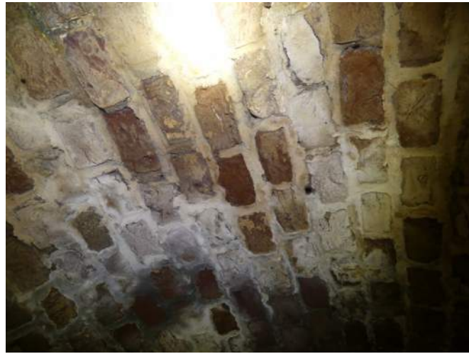
Afb. 12.22.20, uitbloei op gewelfvoegwerk, duidend op vochttransport
