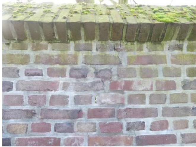
Afb. 05.22.01, gescheurd metselwerk onder ezelsrug
