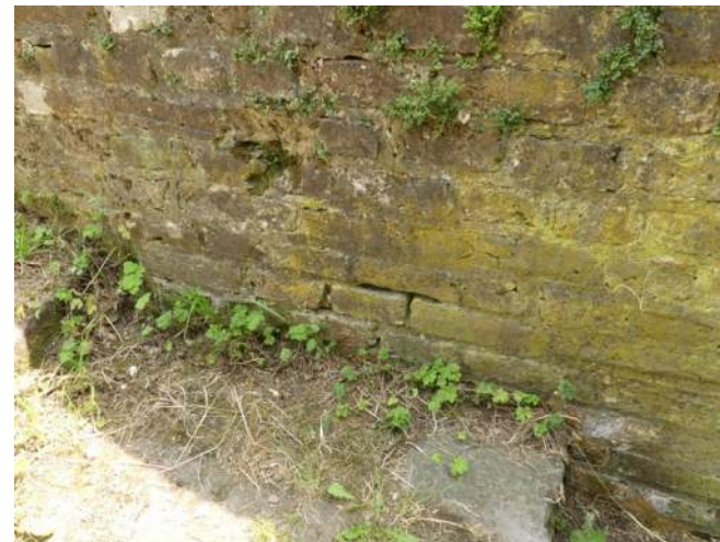
Afb. 05.22.03, kapotte stenen (door te harde voegmortel)
