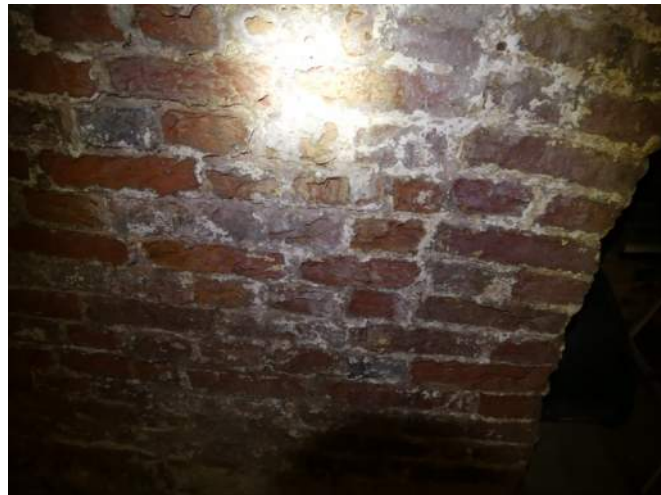
Afb. 12.22.22, verzandend- en uitgevallen gewelfvoegwerk
