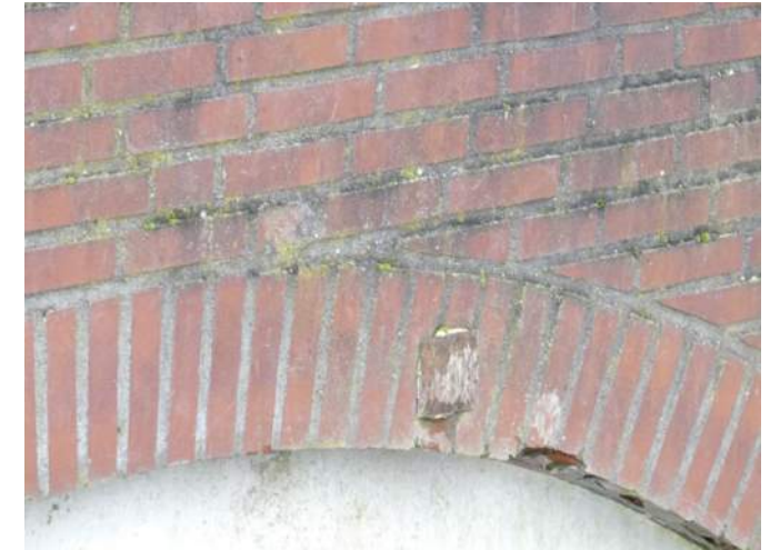
Afb. 04.22.10, alg- en mosgroei, afgebroken stenen
