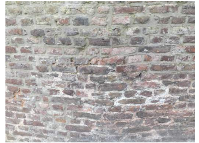
Afb. 10.22.08, uitvallend, te ondiep uitgehaald, herstelvoegwerk waaronder mogelijk originele legmortel zichtbaar (bruingele kleur)
