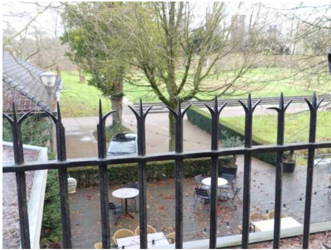
Afb. 04.43.15, verbogen en afgebroken hekwerkpunten
