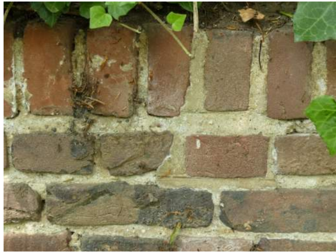
Afb. 11.22.14, redelijk uitziend, maar onvoldoende diep uitge- uitgehaald en daardoor slecht hechtend en weer uitgevallen voegwerk
