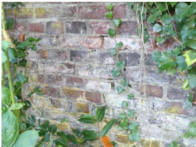
Afb. 06.22.11, foutief hersteld, weer loszittend en uitgevallen voegwerk
