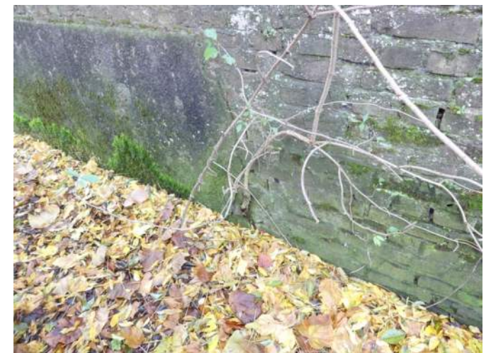
Afb. 06.22.18, loszittend en uitgevallen voegwerk in de plintzone
