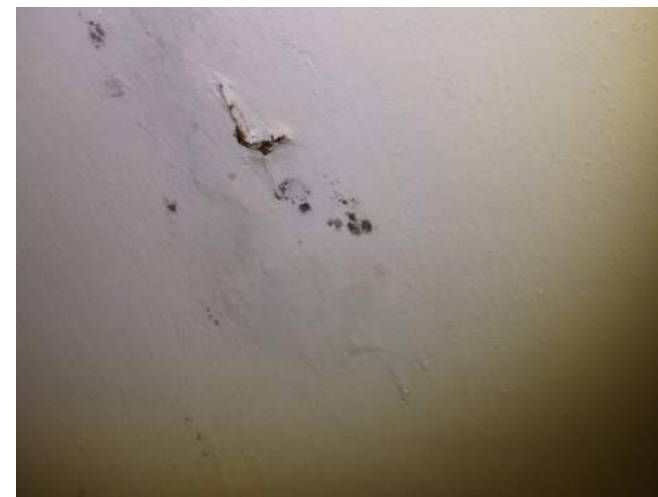
Afb. 12.40.07, roestend ijzerwerk en vervuild pleisterwerk
