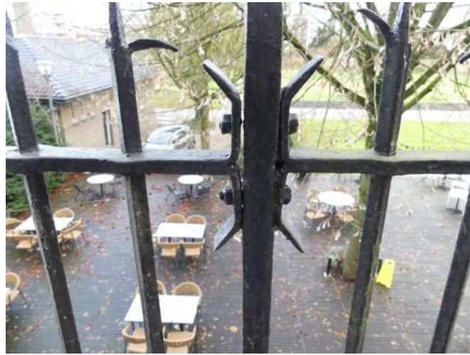
Afb. 04.43.16, doorgescheurde zeskantmoer (te strak aangedraaid of thermisch sterk gekrompen) en afgebroken hekwerkpunten
