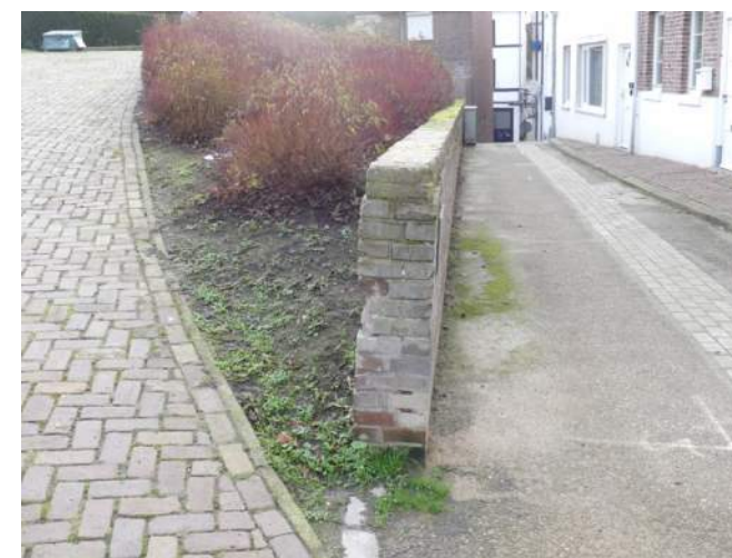
Afb. 08.22.04, beschadigde stenen bij lage walmuur
