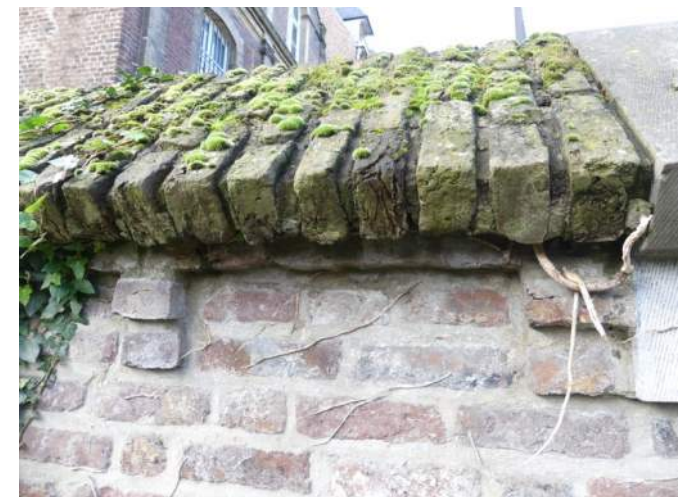
Afb. 05.22.41, alg- en mosgroei en uitgespoeld voegwerk uit ezelsrug
