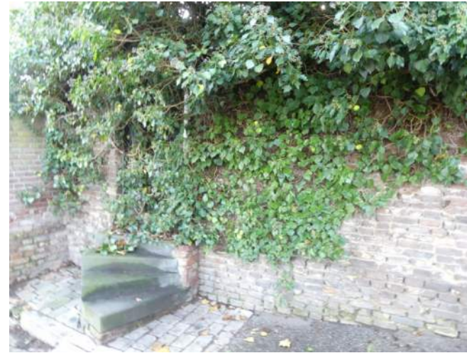
Afb. 05.22.61, volledig overgroeide muur
