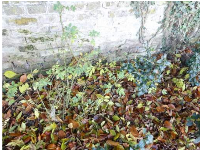
Afb. 06.22.10, uitgespoeld voegwerk thv maaiveld
