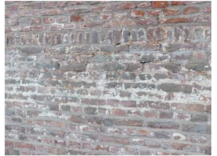
Afb. 03.22.10, overzicht grachtmuur met begroeiing en schade
