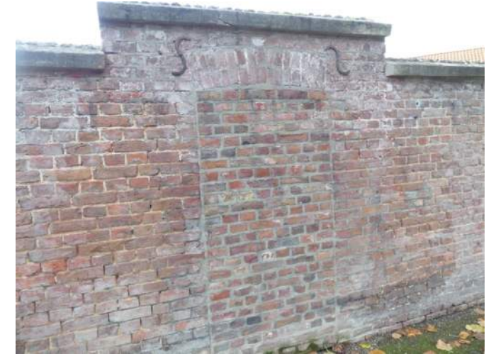
Afb. 08.22.16, versleten voegwerk rondom dichtgezette poort, in de poortvulling detonerend voegwerk
