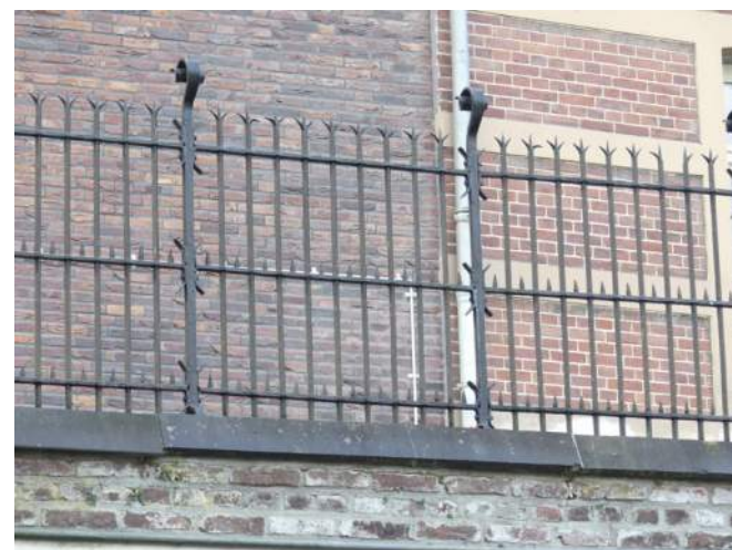
Afb. 04.35.13, slecht gemaatvoerde en gestelde afdekken
