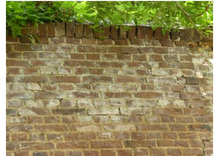
Afb. 11.22.20, uitgespoeld voegwerk uit de rollaag en walmuur
