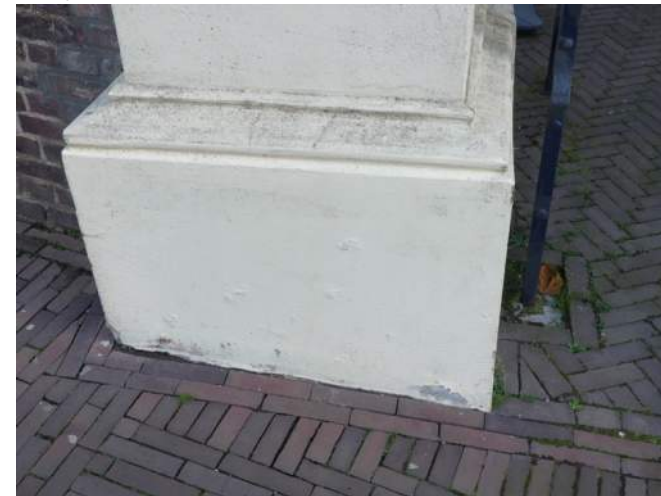
Afb. 06.46.01, loszittend verfwerk boven bestrating (waarschijnlijk onvoldoende doorgezet onder maaiveld)
