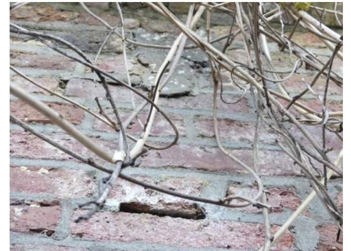
Afb. 06.22.16, uitgevallen en grof, zeer slordig hersteld voegwerk
