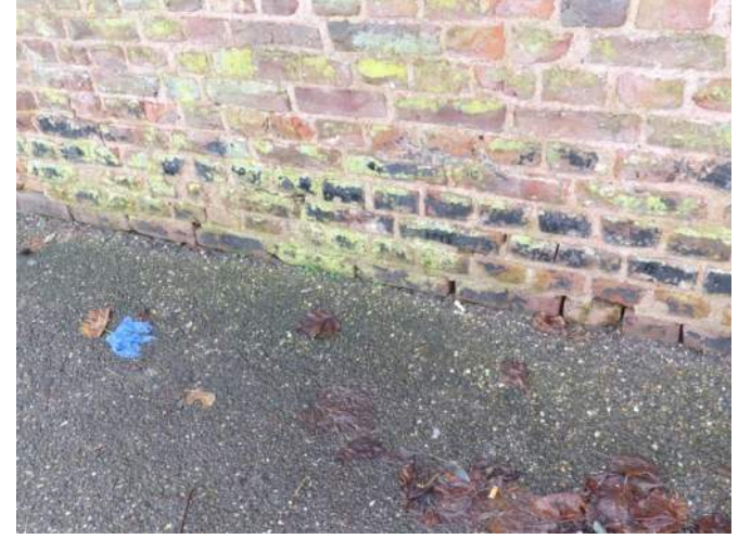
Afb. 03.22.12, ontbrekend voegwerk maaiveld/straatniveau
