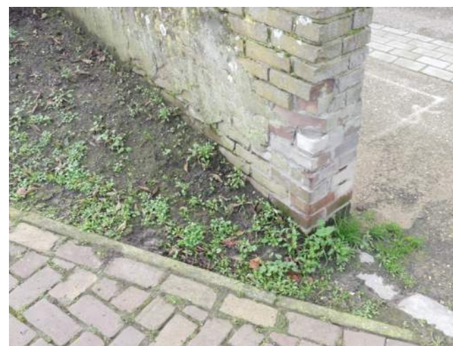
Afb. 08.22.03, beschadigde stenen bij lage walmuur
