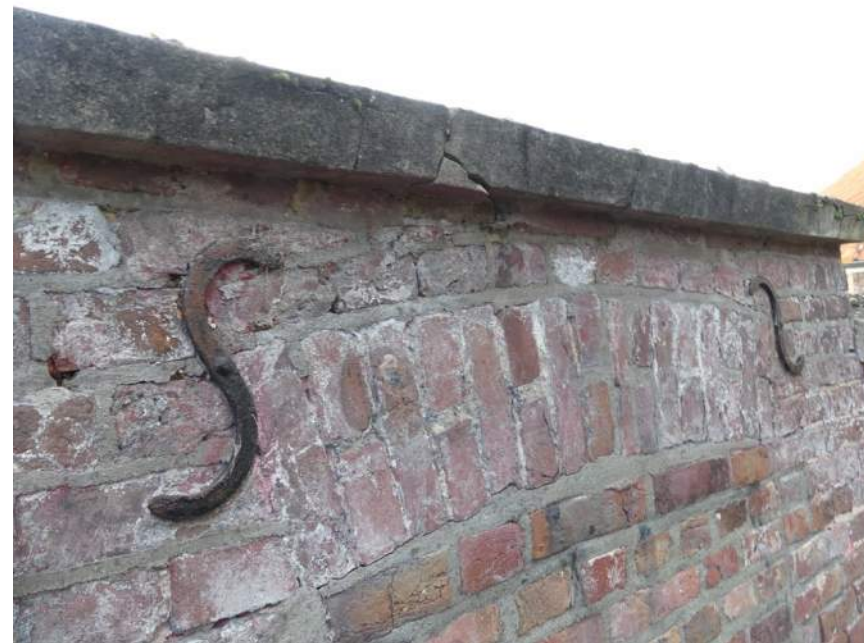
Afb. 08.40.01, beschadigd pleisterwerk van de ezelsrug
