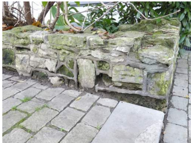
Afb. 05.35.12, foutief hersteld, veel te hard, voegwerk
