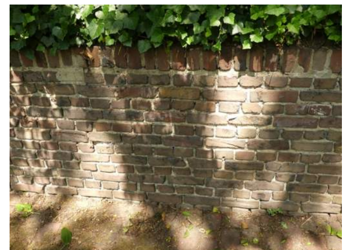
Afb. 11.22.12, uitgesleten voegwerk lage walmuur
