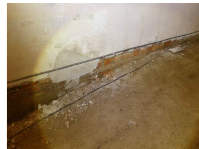
Afb. 12.40.12, beschadigd en afgevalen pleisterwerk
