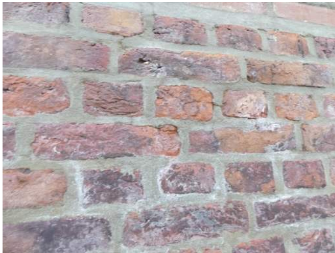
Afb. 05.22.22, slordig aangebracht voegwerk (niet nagestreken)
