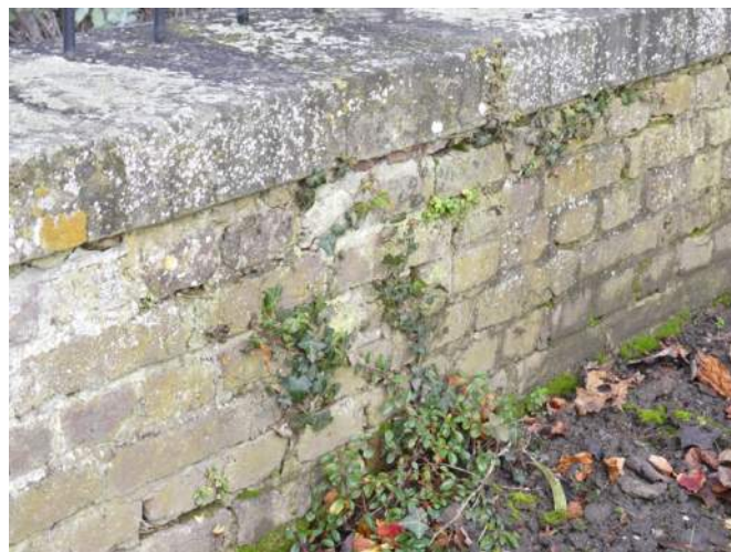
Afb. 04.22.37, cracquelé voegwerk kerkhofmuurtje
