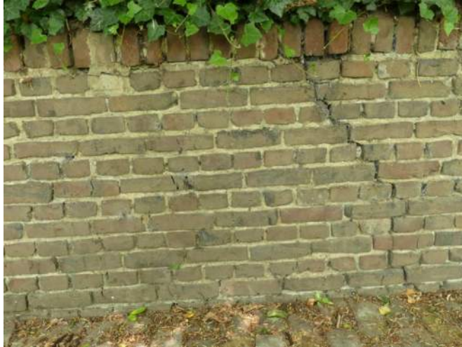
Afb. 11.22.01, gescheurd metselwerk, omhoog gedrukte rollaag en uitgesleten voegwerk
