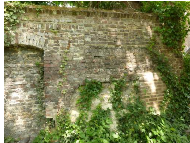
Afb. 11.22.09, gedefformeerd en weggefallen metselwerk
