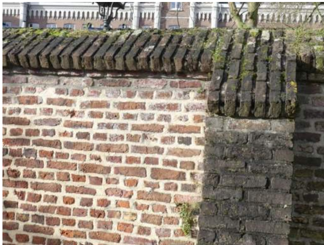
Afb. 05.22.34, alg- en mosgroei en uitgespoeld voegwerk uit ezelsrug
