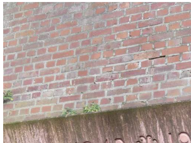
Afb. 05.22.25, loszittend en uitgevallen voegwerk
