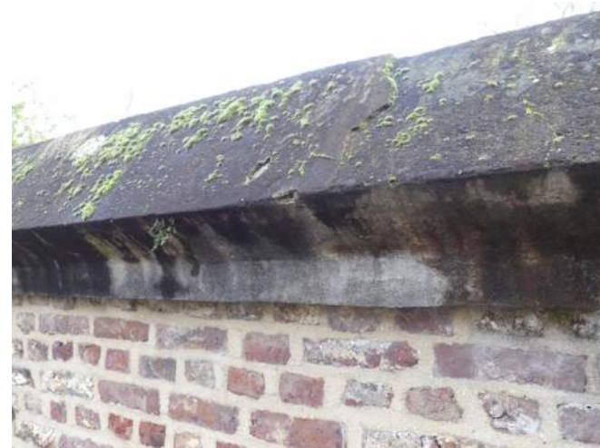
Afb. 05.40.03, gescheurde en ontzette pleisterwerk afdekkap
