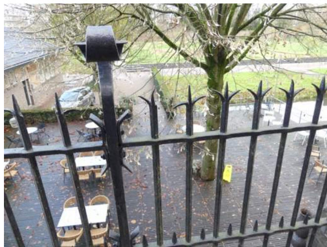
Afb. 04.43.18, verbogen en afgebroken hekwerkpunten
