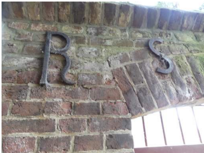
Afb. 04.22.17, gescheurd metselwerk, beschadigde stenen
