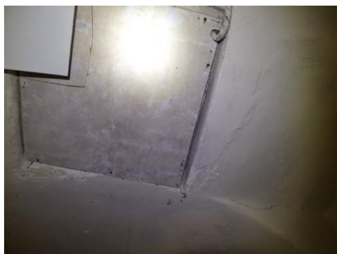
Afb. 12.40.05, gescheurd en beschadigd pleisterwerk
