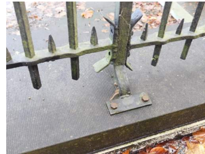
Afb. 04.43.11, aan baluster vastgelaste hekwerkbeugel met slordig aangelaste bevestigingsstrip met zeskantbouten in afdek bevestigd
