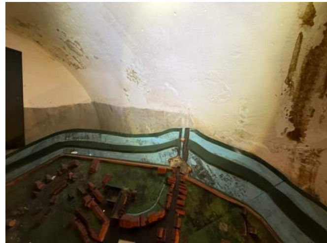
Afb. 12.40.02, beschadigd en afgebladderd gewelfpleisterwerk
