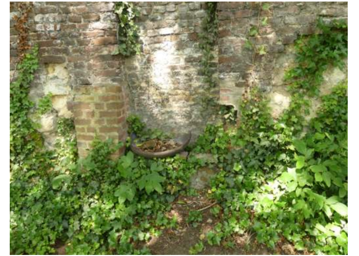
Afb. 11.22.08, gedefformeerd en uitgevallen metselwerk (rechts) en detonerend herstel (links)
