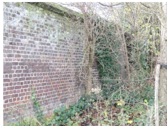
Afb. 04.22.57, niet tijdig gesnoeide en/of van de muur weggehouden klimplant
