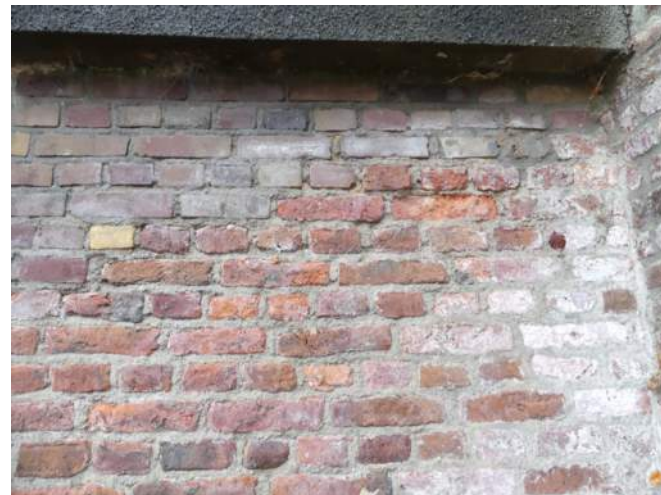
Afb. 04.22.04, afgeschilferde steen, cementsluier over (mogelijk) hersteld werk
