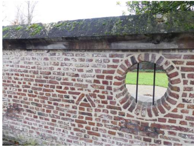
Afb. 05.40.06, beschadigde pleisterwerk afdekkap
