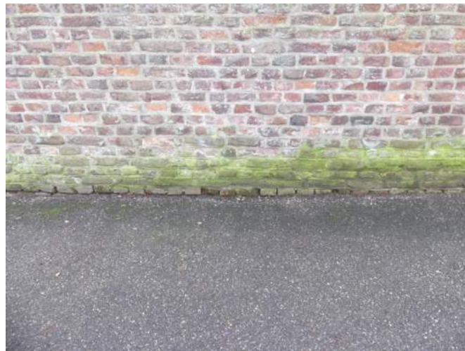
Afb. 10.22.04, kapotte steen en detonerend (foutief hersteld) voegwerk
