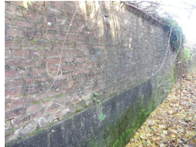
Afb. 06.40.07, geheel verdwenen pleisterwerk boven plintzone
