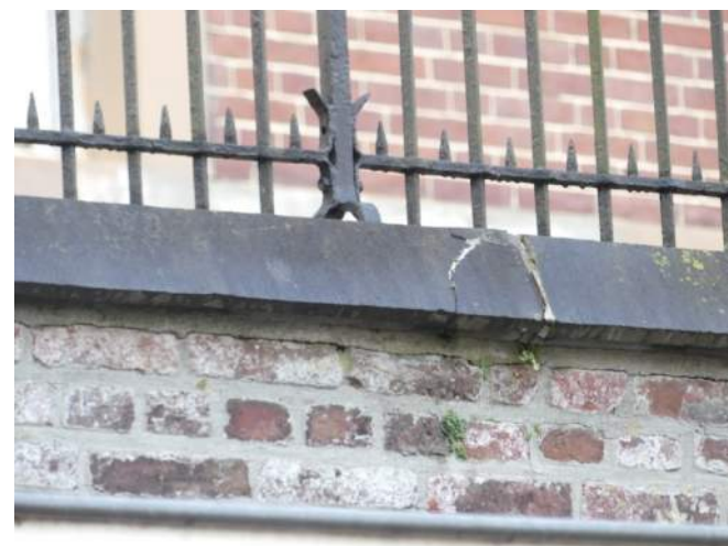
Afb. 04.35.15, losgebroken hoekje waarboven een slechte reparatie en slordig kitwerk
