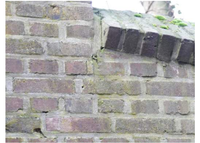
Afb. 05.22.06, gescheurd metselwerk bij verspringing in hoogte
