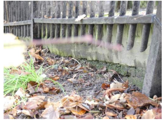
Afb 05.43.04, detail slecht gestelde hekwerken
