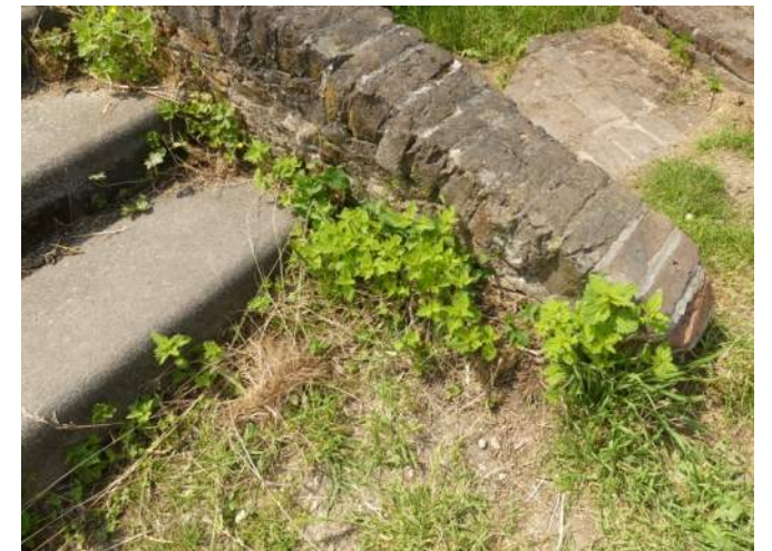
Afb. 05.22.04, kapotte stenen (door te harde voegmortel)
