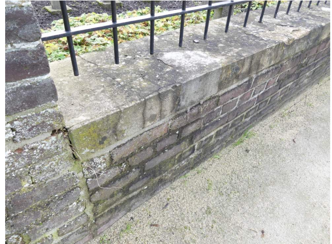
Afb. 04.40.01, gescheurd pleisterwerk op kerkhofmuurtjes Ursulinenkerkhof
