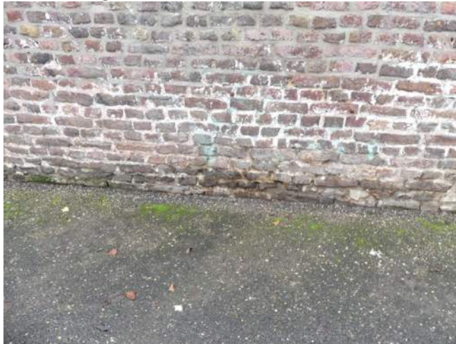
Afb. 10.22.05, uitgespoeld voegwerk bij maaiveld
