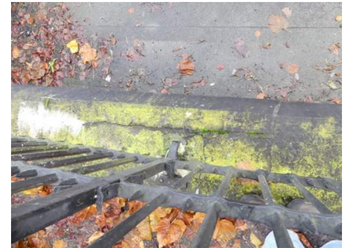
Afb. 04.35.02, originele bevestiging balusters, gescheurde voorzijde met mos en uitbloei
