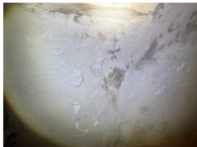
Afb. 12.40.06, beschadigde pleisterwerk afdekkap
