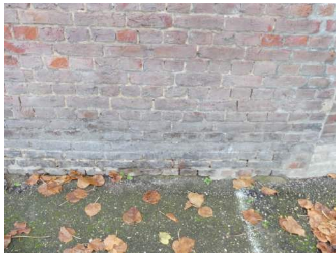
Afb. 08.22.07, uitgespoeld voegwerk bij bestrating
