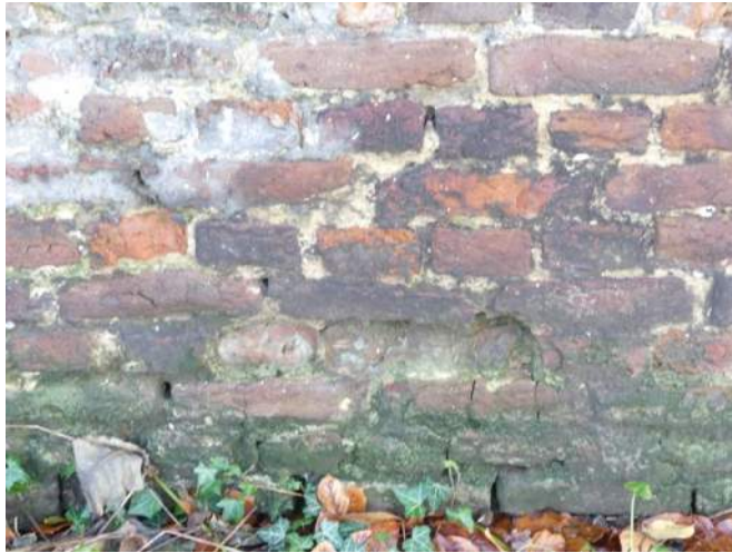
Afb. 05.22.13, vervuild metselwerk, kapotte stenen en uitgespoeld voegwerk
