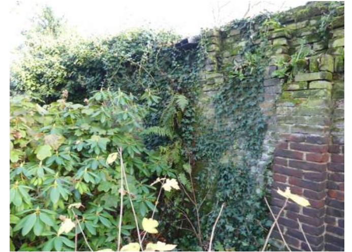
Afb. 05.22.62, volledig overgroeide muur
