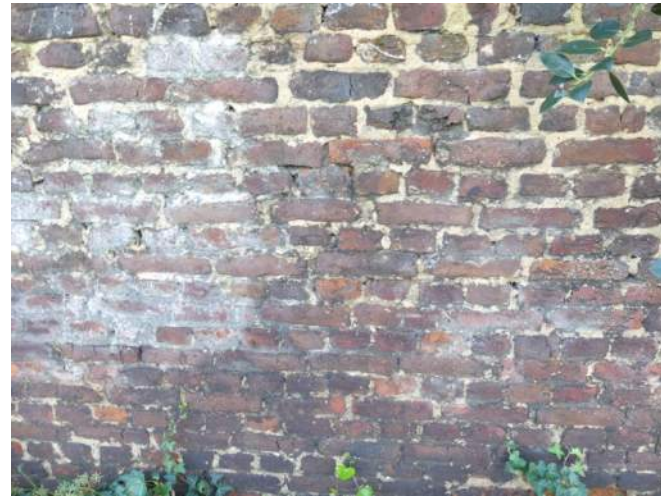
Afb. 05.22.12, vervuild metselwerk en kapotte stenen
