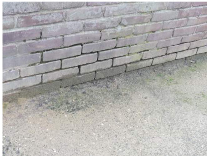
Afb. 08.22.09, uitgespoeld voegwerk bij bestrating
