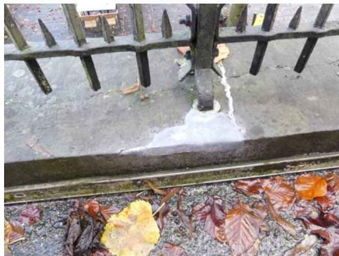
Afb. 04.35.06, detail mortelreparatie: detonerende, (uitbloeiende) mortel en niet geaccordeerde (niet aansluitend op omliggend werk) afwerking
