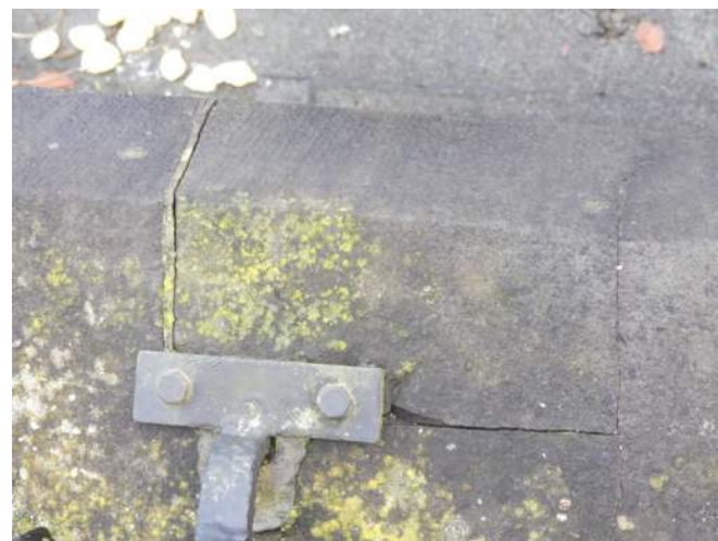
Afb. 04.43.08, aangelaste strip -óver gietlood!- helemaal fout, Inschietblokje is alweer losgescheurd en kapotgebroken tpv zeskantmoer
