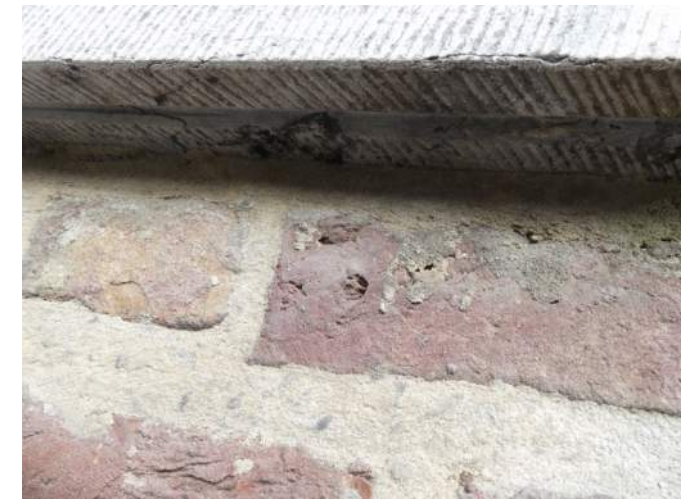
Afb. 05.35.04, brandlagen aan waterlijst
