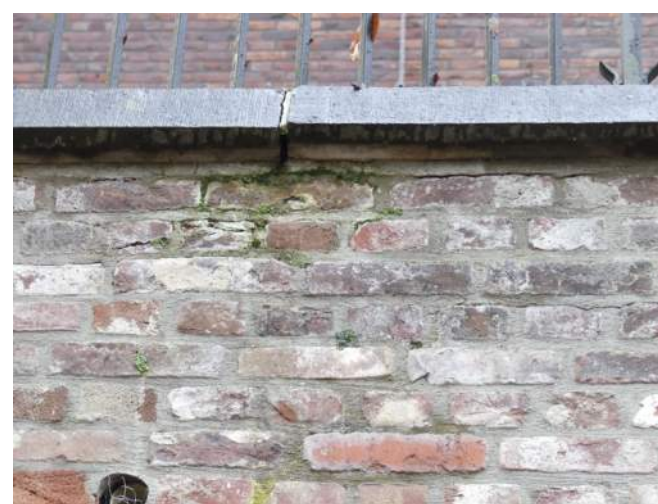
Afb. 04.35.27, losgescheurde mortelvoeg met gevolgschade
