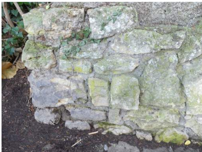
Afb. 07.35.11, ontbrekend blok en losse blokken onderin
