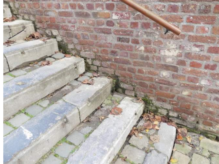
Afb. 08.35.01, verzakte natuursteen bestrating tussen uit verschillende natuursteen blokken samengestelde traptreden
