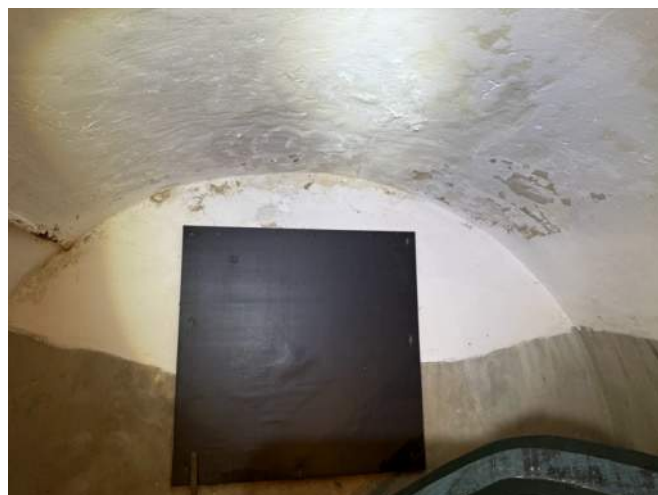
Afb. 12.40.03, beschadigd en afgebladderd gewelfpleisterwerk
