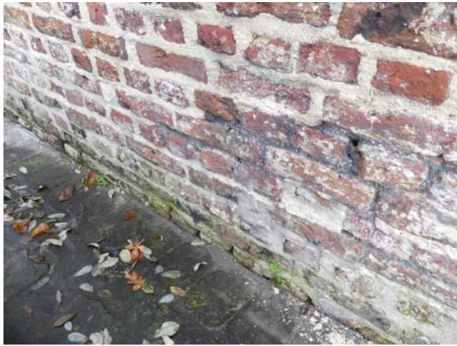
Afb. 05.22.32, uitgespoeld voegwerk en uitgevallen voegen
