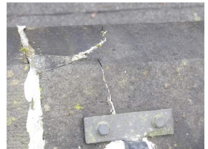
Afb. 04.35.04, foutieve bevestiging balustervoet, losgescheurde hoek, (kalk?)-verlijming en slordige kitnaad
