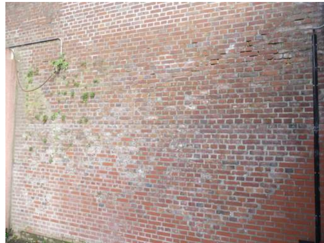
Afb. 05.22.23, met muurvegetatie begroeide en uitgevallen voegen
