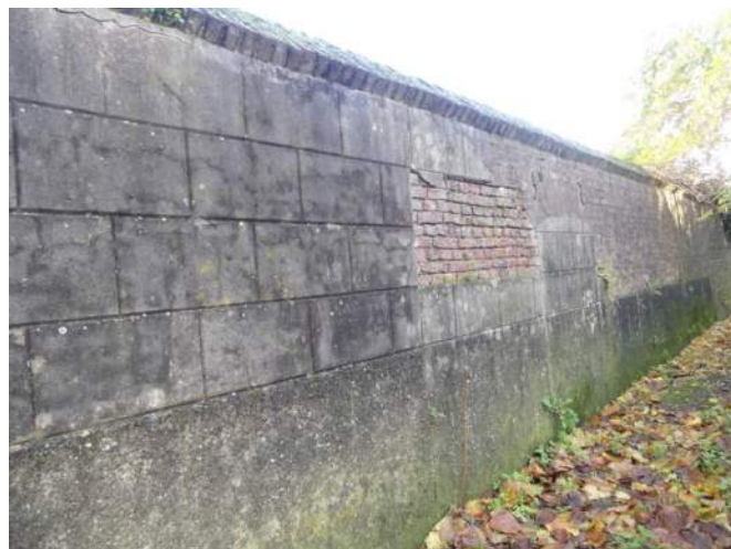
Afb. 06.40.06, afgevalen stukken pleisterwerk
