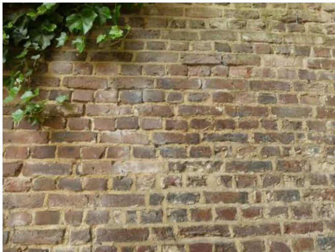
Afb. 11.22.17, versleten en uitgevallen voegwerk
