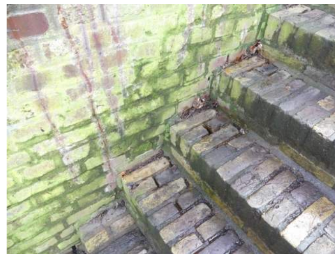
Afb. 05.22.50, door te langdurige waterbelasting uitgesleten en uitgespoeld voegwerk uit de traptreden
