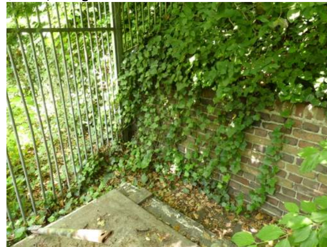
Afb. 11.22.21, begroeiing over lage walmuur
