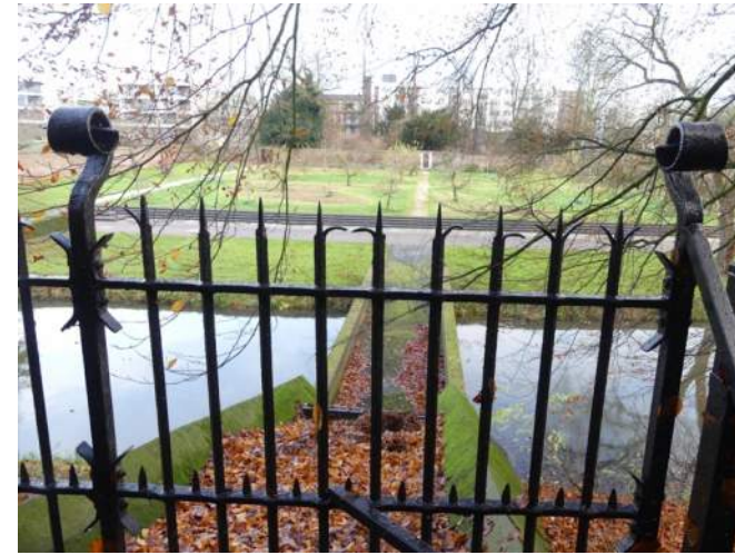
Afb. 04.43.21, verbogen en afgebroken hekwerkpunten
