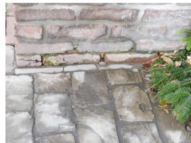
Afb. 05.22.53, uitgespoeld voegwerk boven straatwerk
