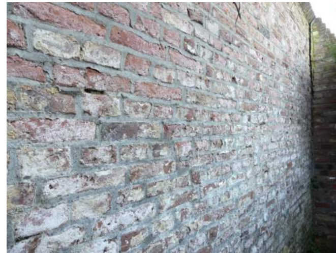
Afb. 06.22.15, te ondiep uitgehaald en weer uitgevallen voegwerk
