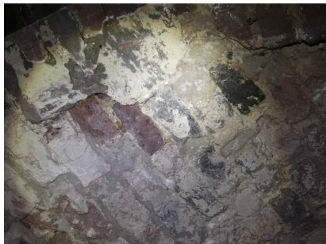
Afb.12.22.24, gescheurd en uitgevallen gewelfvoegwerk
