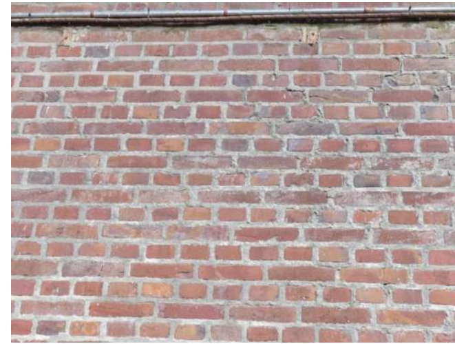
Afb. 05.22.26, slordig verzorgd voegwerk
