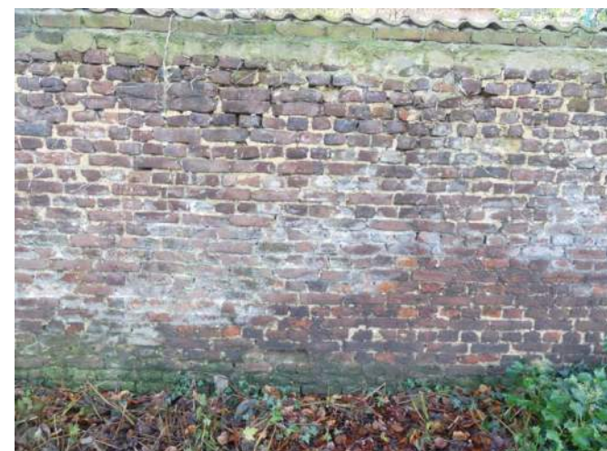
Afb. 05.22.42, versleten en uitgespoeld (origineel) voegwerk en Uitgespoeld voegwerk bij maaiveld
