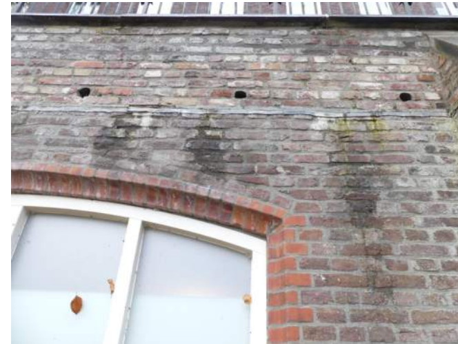
Afb. 04.22.19, lekkagesporen onder muurlood
