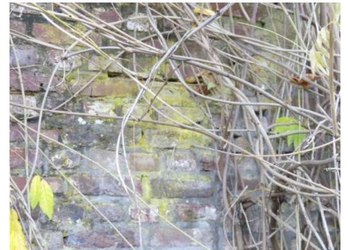
Afb. 06.22.14, loszittend en uitgevallen voegwerk achter begroeiing
