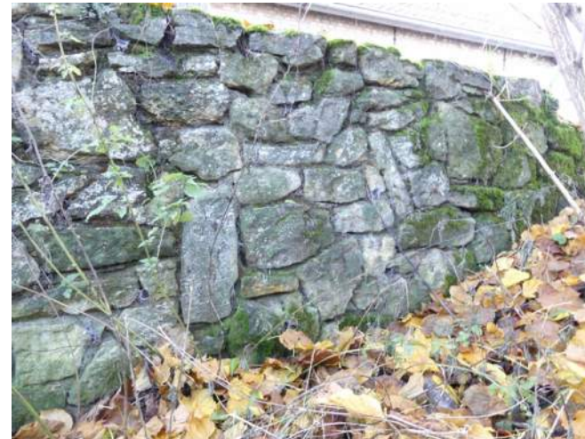
Afb. 07.35.14, uitgevallen, onvoldoende hechtend, voegwerk
