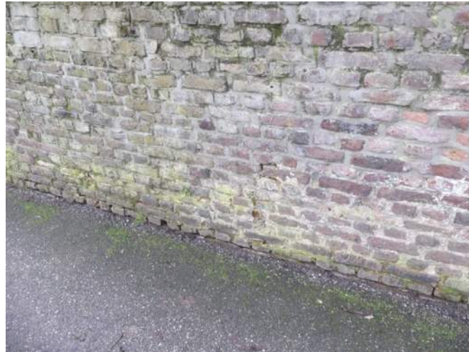
Afb. 10.22.06, uitgespoeld voegwerk bij maaiveld
