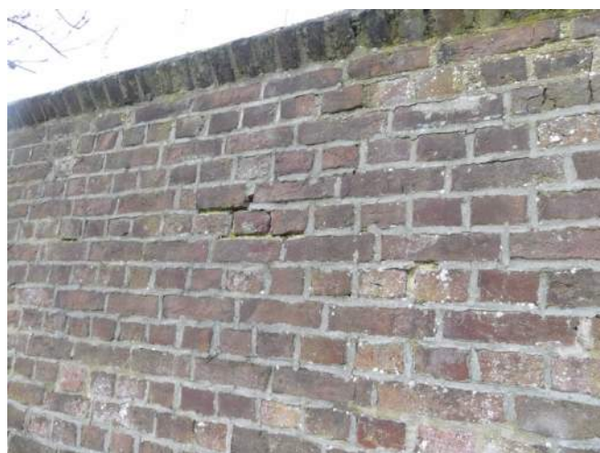
Afb. 04.22.40, losgescheurd en uitgevallen voegwerk, te ondiep uitgehaalde reparatie
