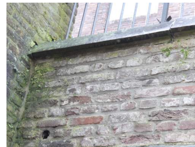
Afb. 04.35.14, slecht gemaatvoerde en gestelde afdek
