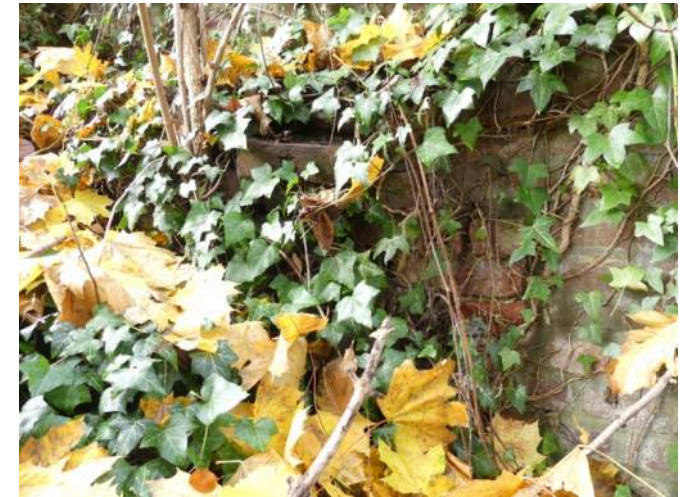
Afb. 05.22.08, gedefformeerd metselwerk onder begroeiing
