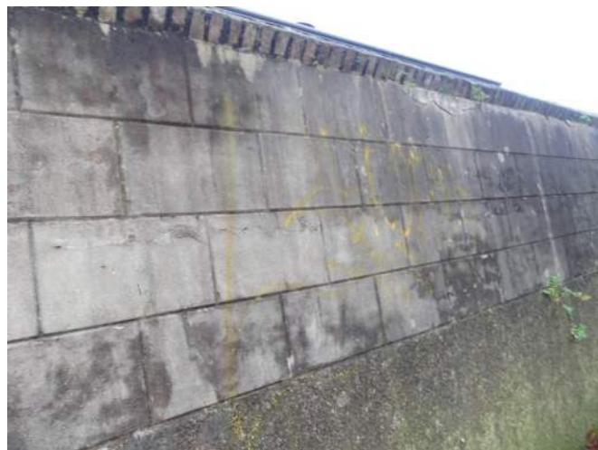
Afb. 06.40.05, gescheurd pleisterwerk en losse schollen
