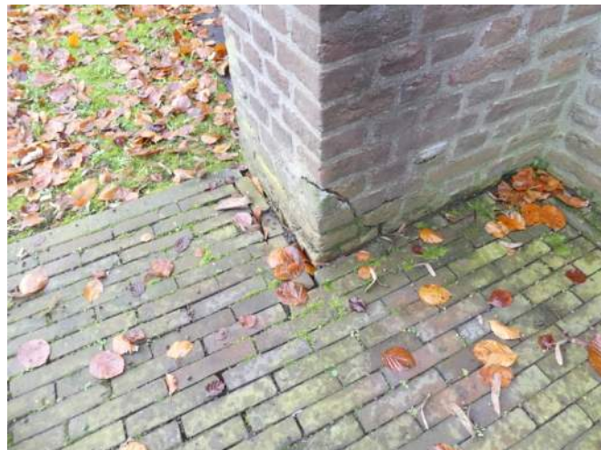
Afb. 04.22.03, gescheurde, vermoedelijk mechanische beschadigde, hoek metselwerk
