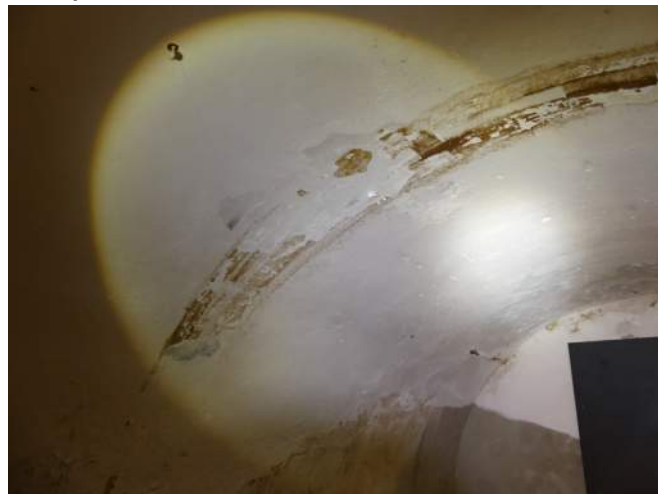
Afb. 12.40.01, vervuild en beschadigd pleisterwerk
