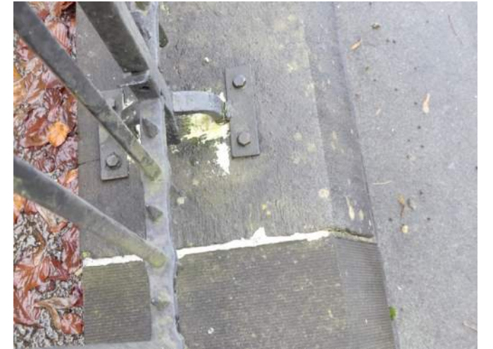
Afb. 04.35.24, slecht aangebrachte kitvoeg: schuine mortelvoeg is losgescheurd
