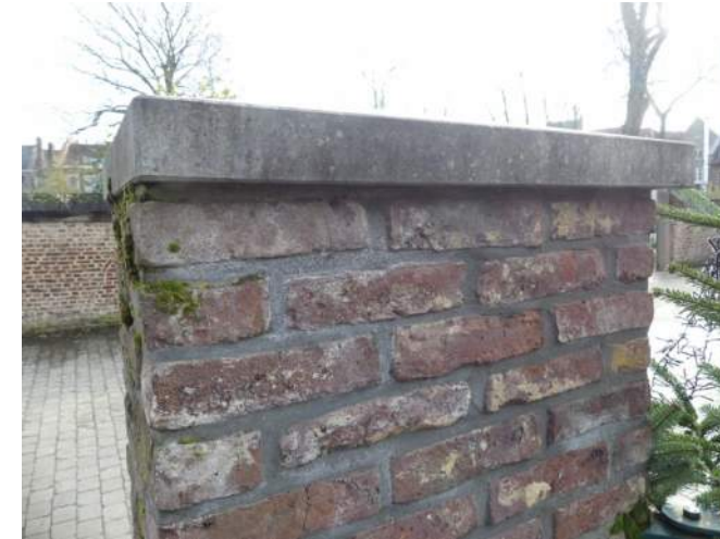
Afb. 05.35.01, foutief gemaatvoerde (of geplaatste) penantafdek - overstek ontbreekt
