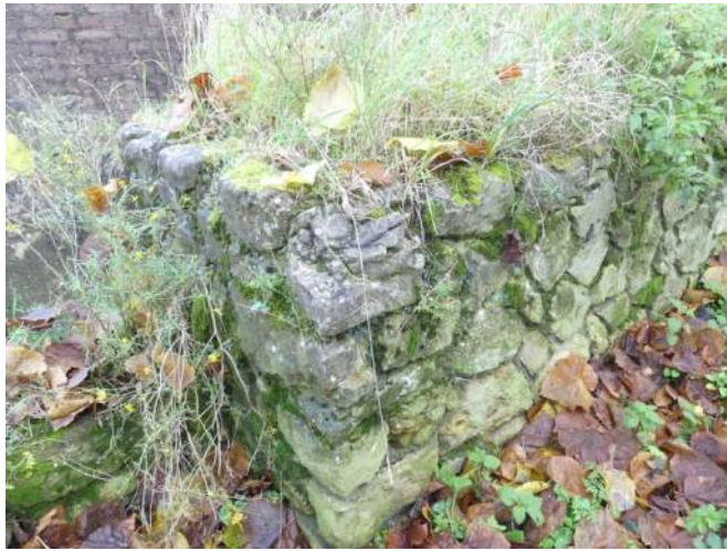
Afb. 07.35.07, gedelamineerd blok natuursteen en forse vegetatie
