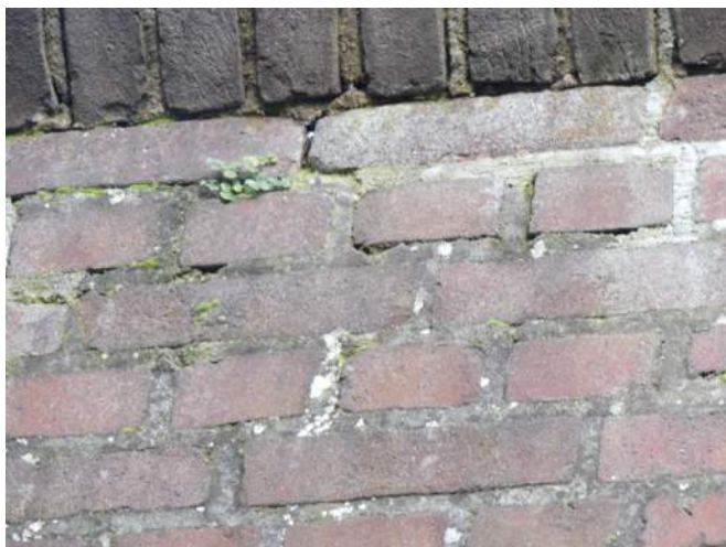
Afb. 05.22.24, slordig hersteld voegwerk met muurvegetatie en losse en uitgevallen voegen
