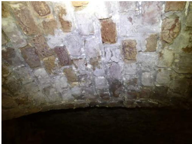
Afb. 12.22.21, uitbloei op gewelfvoegwerk, duidend op vochttransport
