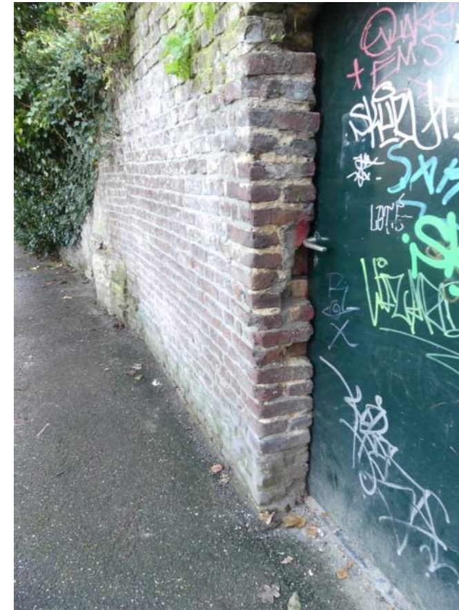
Afb. 05.22.16, beschadigde stenen in poortopening
