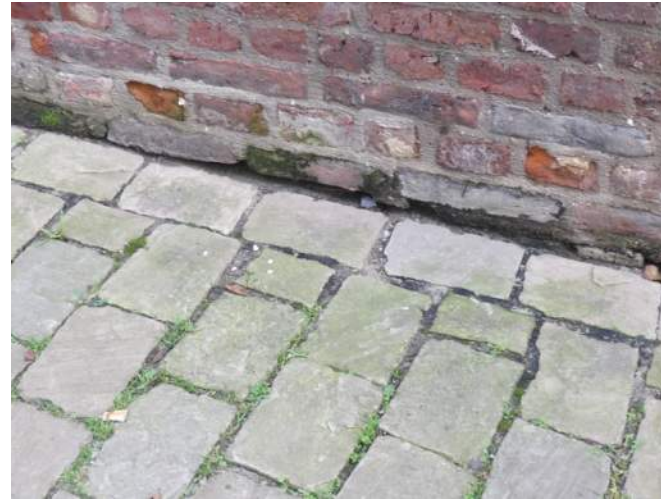
Afb. 08.22.10, uitgespoeld voegwerk bij bestrating
