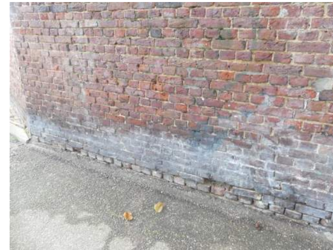
Afb. 08.22.02, kapotte stenen en uitgespoeld voegwerk thv maaiveld
