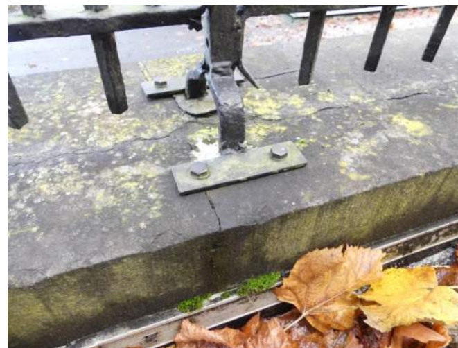
Afb. 04.43.06, slordig aangelaste 'herstel'-voetjes met zeskantmoeren bevestigd in afdekken,
