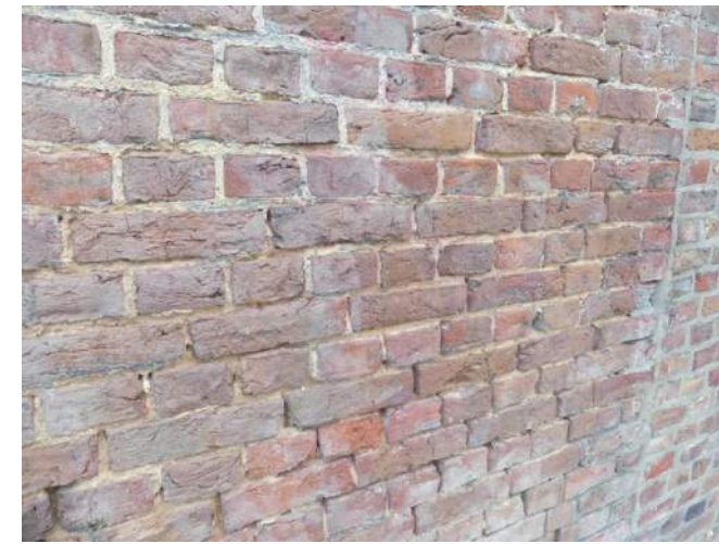
Afb. 08.22.13, uitgesleten voegwerk en slordig herstelwerk
