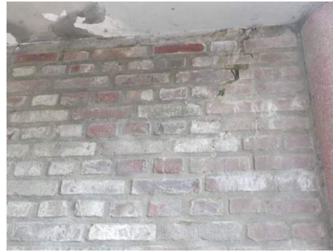
Afb. 05.22.05, watervoerende scheur onder betondek
