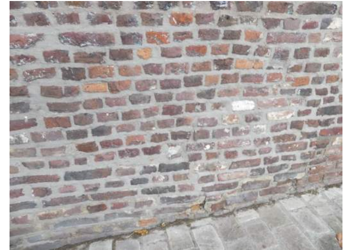
Afb. 10.22.10, foutief hersteld en (weer) losscheurend voegwerk
