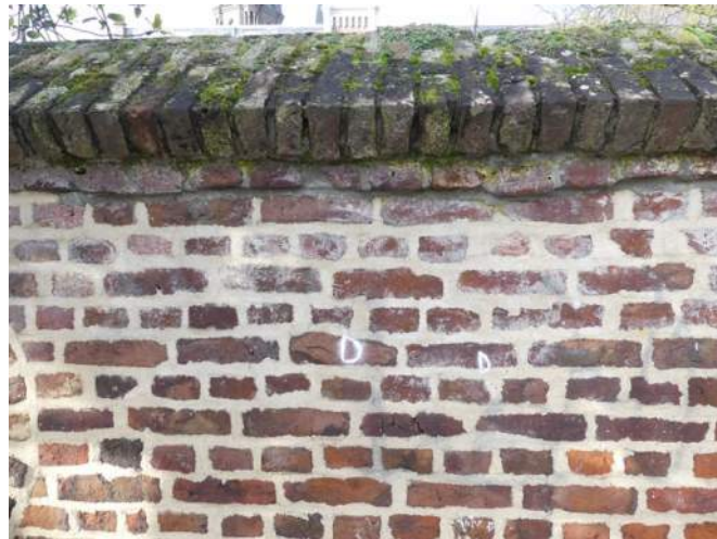
Afb. 05.22.35, alg- en mosgroei en uitgespoeld voegwerk uit ezelsrug
