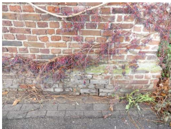
Afb. 04.22.30, gescheurd en uitgespoeld voegwerk plintzone
