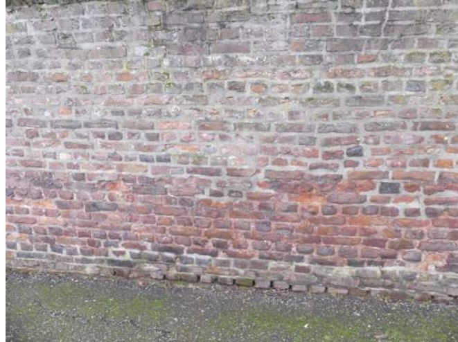
Afb. 10.22.02, afgeschilferde stenen en uitgespoeld voegwerk bij maaiveld
