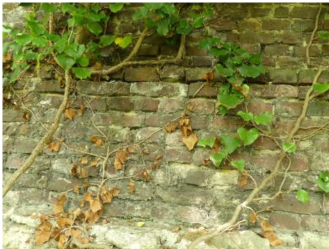
Afb. 11.22.15, versleten en uitgesleten voegwerk, begroeiing
