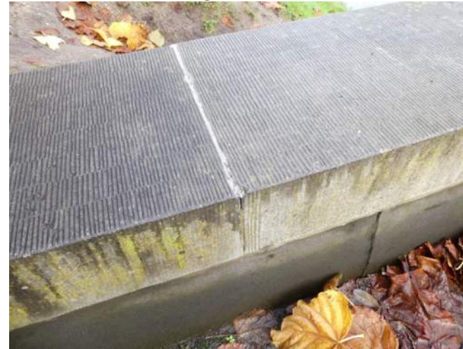
Afb. 04.35.23, slecht gesloten kitvoeg tussen afdekken
