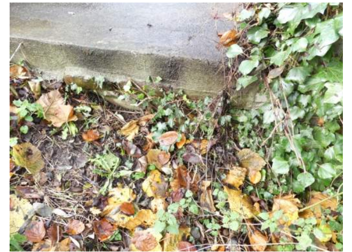
Afb. 05.21.02, uitgezakte, inwaterende bakstenen onder het betondek
