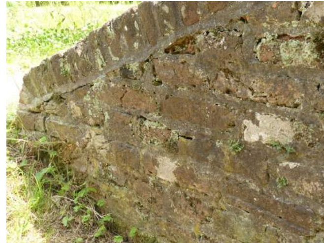
Afb. 12.22.01, kapotte stenen (door te harde voegmortel)
