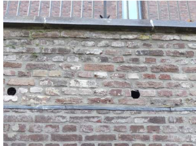
Afb. 04.22.02, gescheurd metselwerk onder afdek
