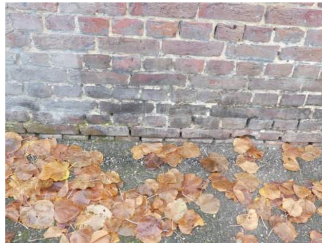
Afb. 08.22.08, uitgespoeld voegwerk bij bestrating
