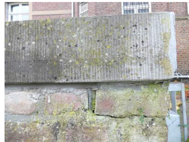
Afb. 04.22.23, slordig afgewerkt met kit afgestreken voegwerk onder afdekken
