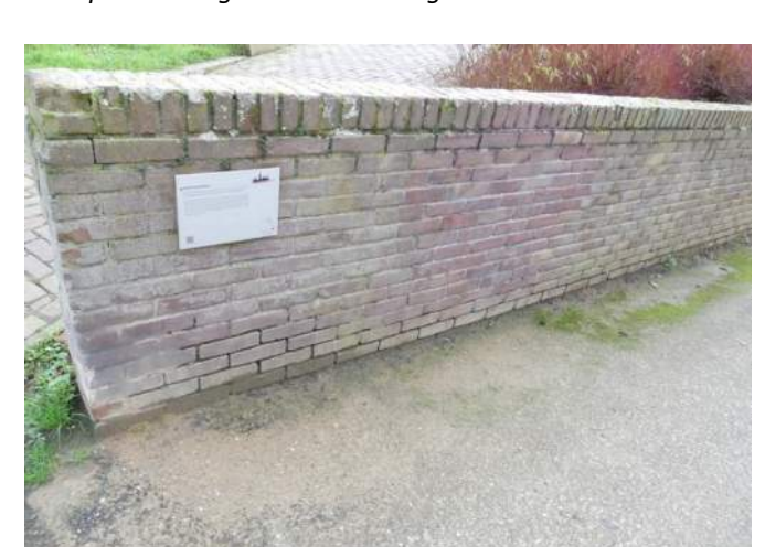
Afb. 08.22.18, uitgespoeld voegwerk en alg- en mosgroei
