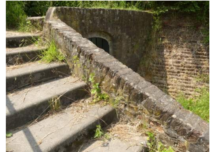
Afb. 05.22.02, kapotte stenen (door te harde voegmortel)
