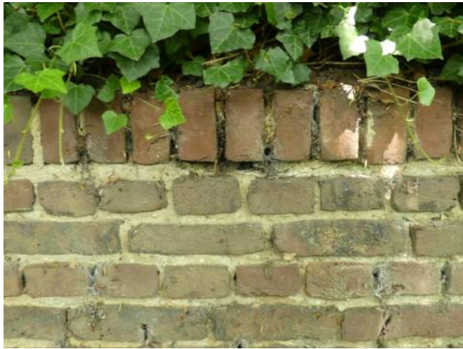
Afb. 11.22.13, diep uitgespoeld/-gesleten voegwerk onder de rollaag
