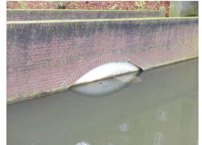
Afb. 04.22.08, zeer vervuilde keer-/brugmuren (door ontbreken overstek met druiprand)
