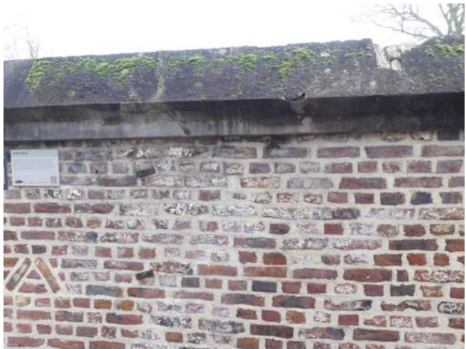
Afb. 05.40.07, beschadigde pleisterwerk afdekkap
