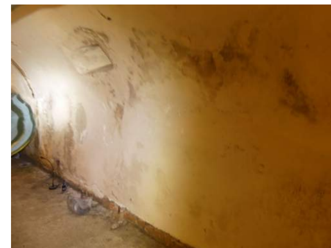
Afb. 12.40.10, beschadigd en verontreinigd pleisterwerk
