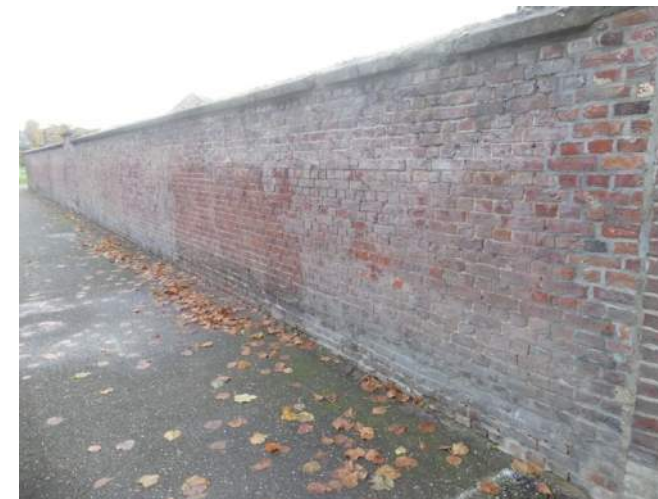
Afb. 08.22.06, foutief hersteld en uitgesleten voegwerk
