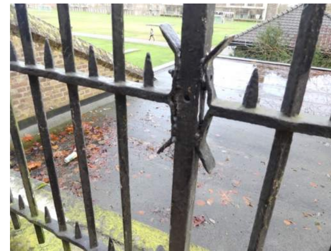
Afb. 04.43.09, vervormde beugel tegen doorgeroeste baluster
