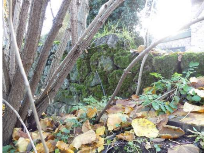
Afb. 07.35.19, uitgesleten en weggevallen voegwerk, forse alg- en mosgroei
