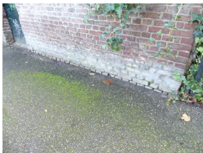
Afb. 05.22.46, uitgespoeld voegwerk bij aansluiting asfalt
