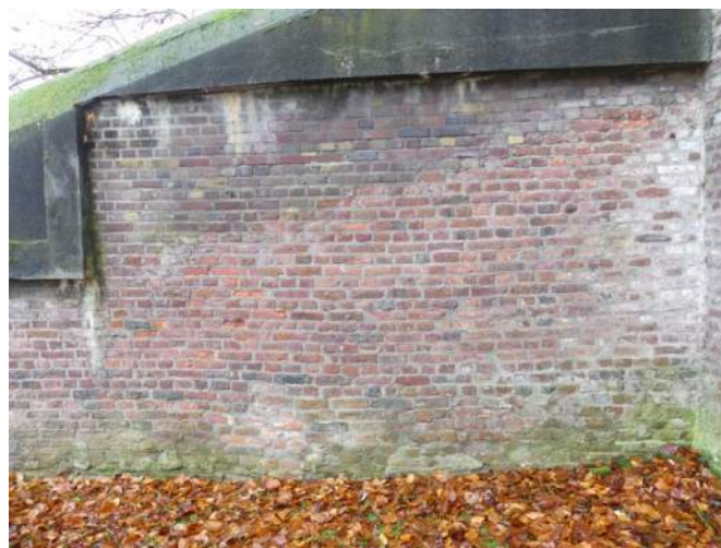
Afb. 04.22.63, kalkuitbloei onder betonnen afdekken
