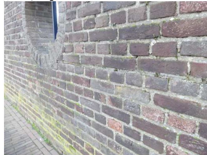
Afb. 06.22.05, slecht hersteld, loszittend en uitvallend voegwerk
