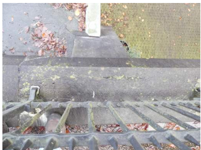
Afb. 04.35.07, losgebarsten neus aan de afdek (staand leger??) en losgescheurd hoekje
