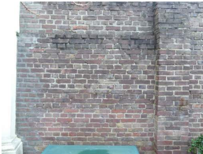
Afb. 06.22.07, vervuild metselwerk en slecht hersteld voegwerk, deels weer uitgevallen
