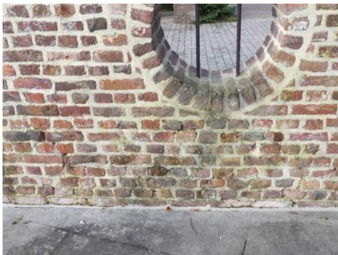
Afb. 05.22.36, slordig hersteld voegwerk en uitgevallen voegen
