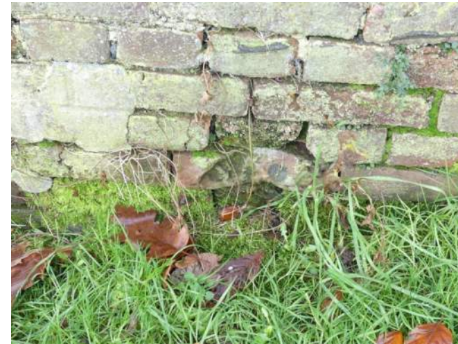
Afb. 04.22.07, beschadigde steen thv maaiveld, uitgespoeld voegwerk
