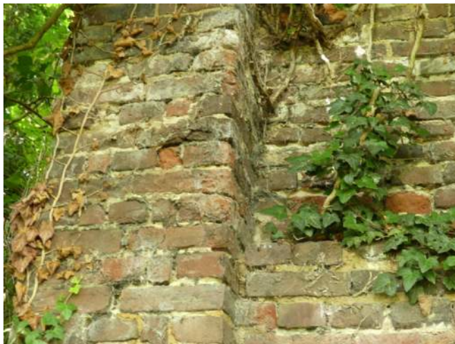
Afb. 11.22.03, afgeschilferde stenen, versleten voegwerk en begroeiing
