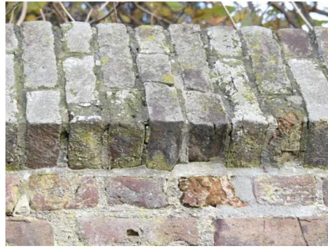
Afb. 04.22.14, gescheurde stenen in ezelsrug
