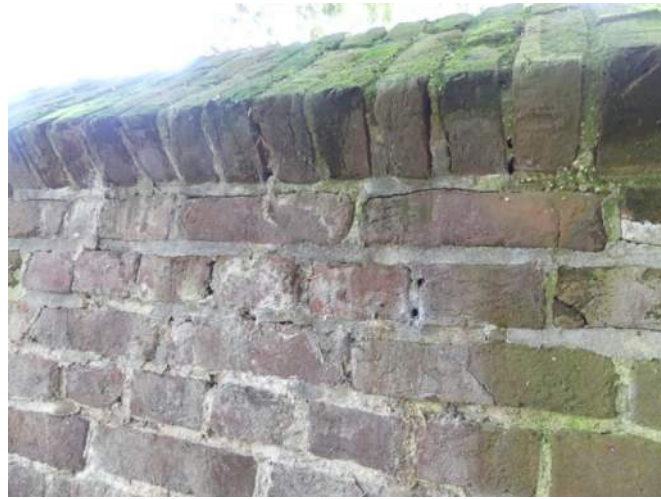
Afb. 04.22.26, loszittend en uitgespoeld voegwerk op en onder ezelsrug
