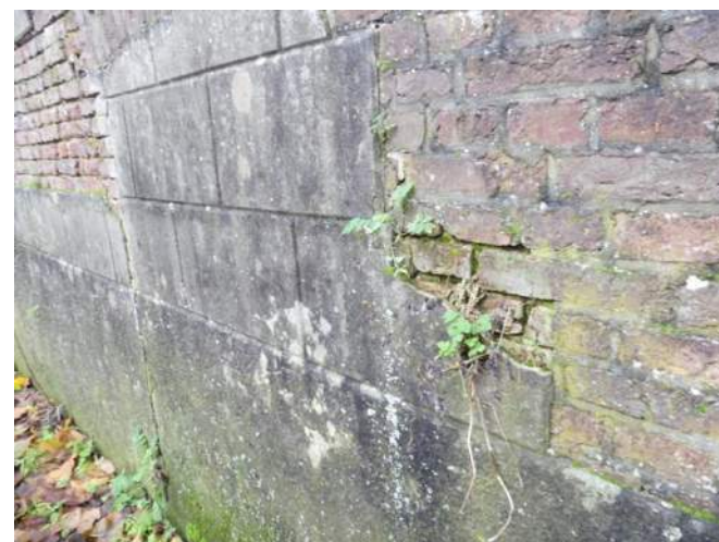
Afb. 06.22.17, uitgespoeld voegwerk tpv weggefallen pleisterwerk
