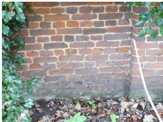
Afb. 05.22.45, versleten, maar waarschijnlijk origineel voegwerk met enkele uitgevallen stootvoegen en onderaan wat slechtere reparaties
