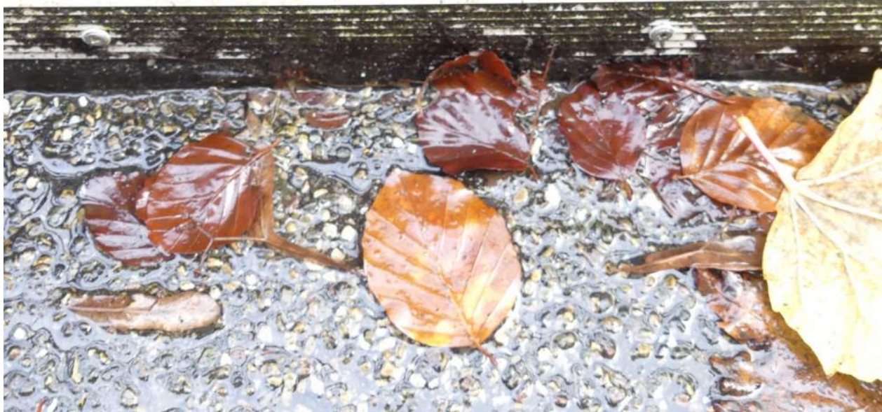
Afb. 04.35.31, losstaande klemstrip, functioneloos; water kan er zo achter lopen (mogelijk causaal verband met afb. 04.22.19/20)
