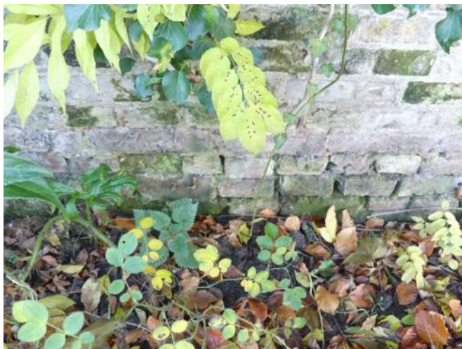
Afb. 06.22.09, uitgespoeld voegwerk thv maaiveld
