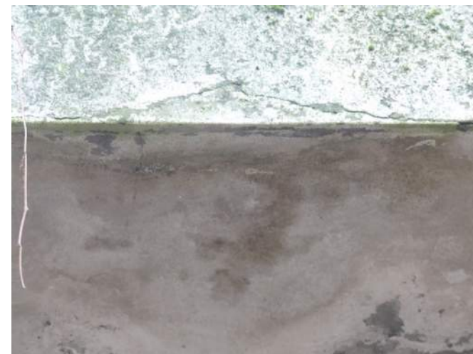
Afb. 05.21.05, haarscheuren in betondek
