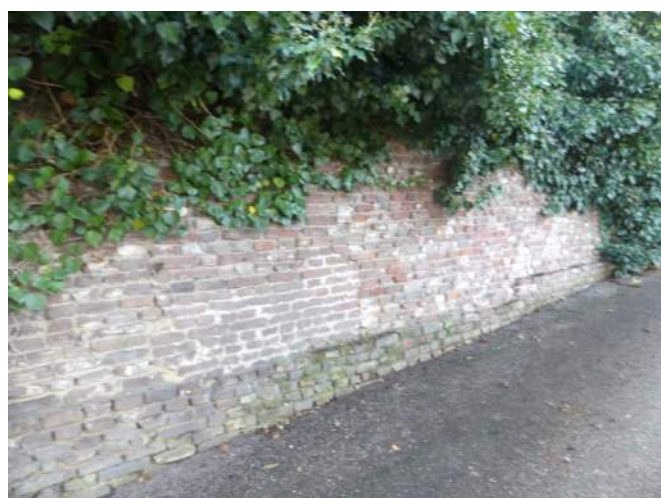
Afb. 05.22.47, uitgespoeld voegwerk bij -vooral- asfalt
