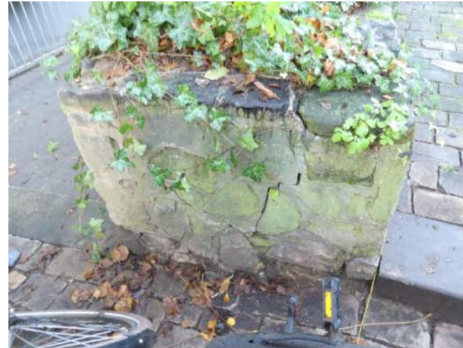
Afb. 01.35.01, gescheurd metselwerk (hoek, mechanisch?)
