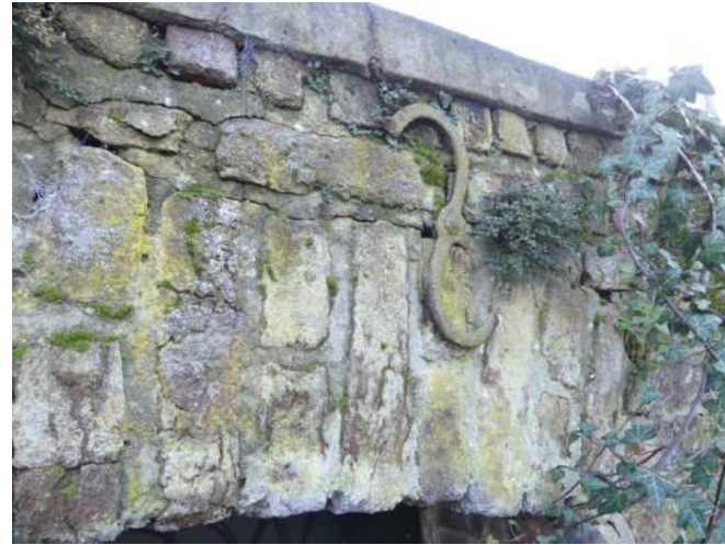
Afb. 05.22.14, losgescheurd metselwerk boven opening, veel begroeiing
