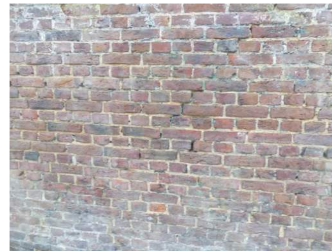
Afb. 08.22.14, uitgesleten en uitgevallen voegen
