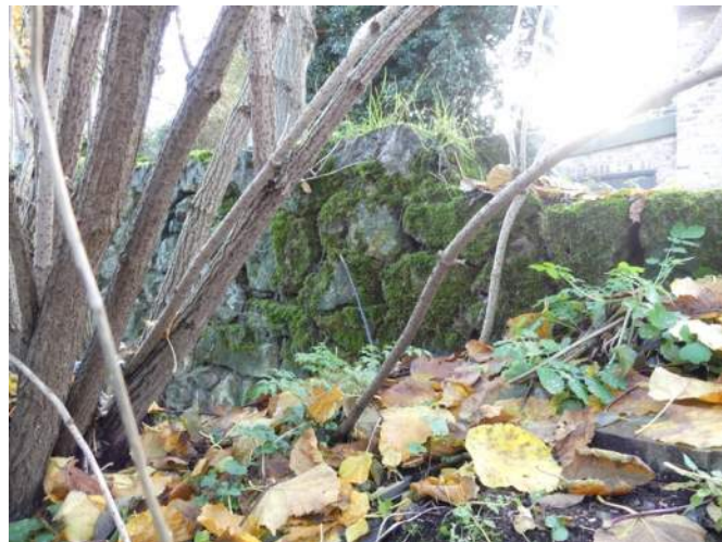
Afb. 07.35.19, uitgesleten en weggefallen voegwerk, forse alg- en mosgroei
