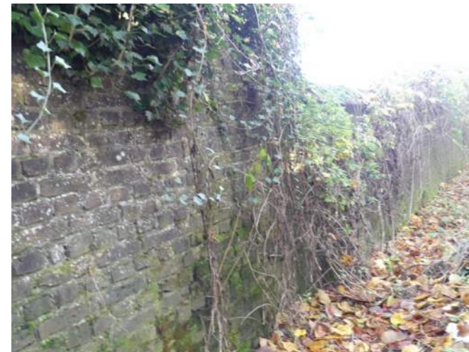
Afb. 06.22.34, volledig met begroeiing vervuilde muur
