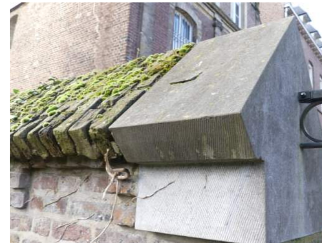
Afb. 05.35.03, beschadigd schuin vlak
