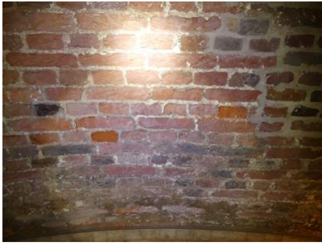
Afb. 05.22.09, afschilferende stenen en slecht voegherstel
