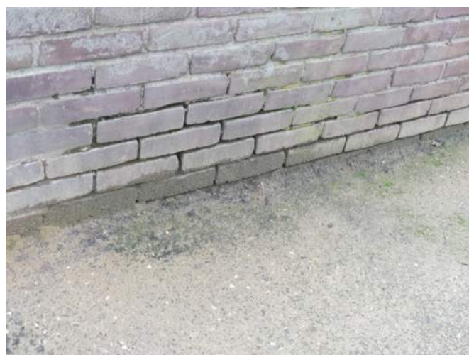
Afb. 08.22.09, uitgespoeld voegwerk bij bestrating
