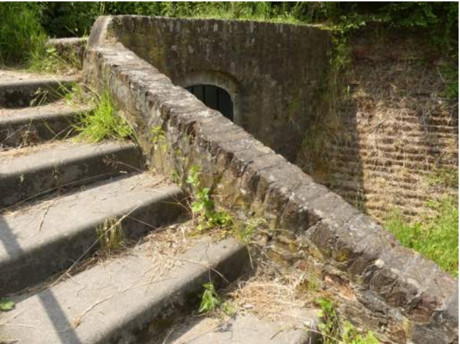
Afb. 05.22.02, kapotte stenen (door te harde voegmortel)
