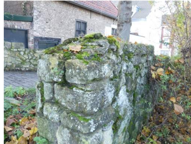
Afb. 07.35.01, ontbrekende blokken natuursteen
