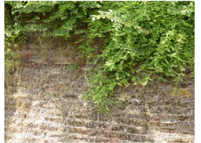
Afb. 12.22.26, overhangende begroeiing en wortelresten op uitkragend liggend metselwerk
