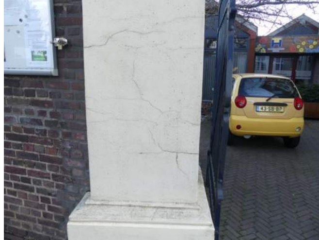
Afb. 06.40.01, craquelé in pleisterwerk linkerpoortpenant
