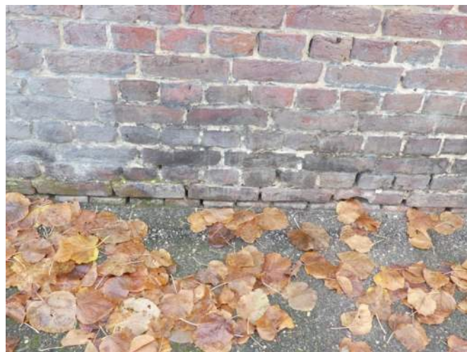
Afb. 08.22.08, uitgespoeld voegwerk bij bestrating
