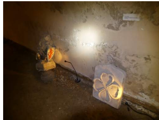
Afb. 12.40.11, beschadigd, afgefallen en verontreinigd pleisterwerk
