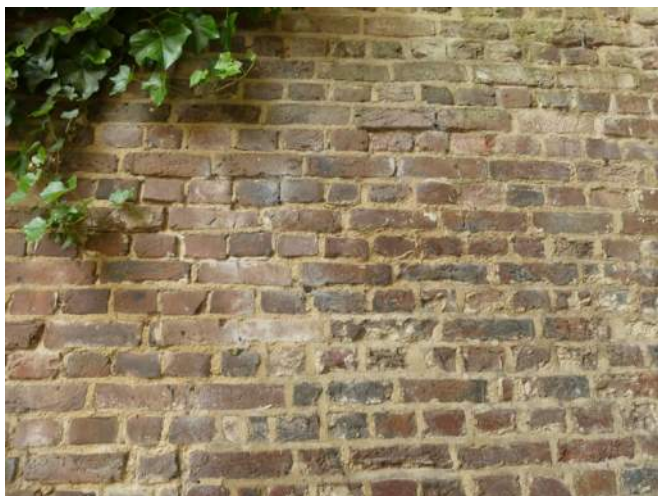
Afb. 11.22.17, versleten en uitgevallen voegwerk
