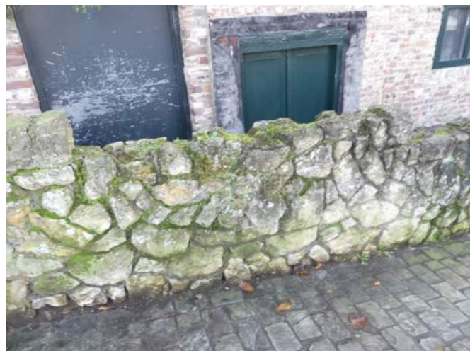
Afb. 07.35.23, met alg en mos begroeide voegen en uitgevallen voegwerk
