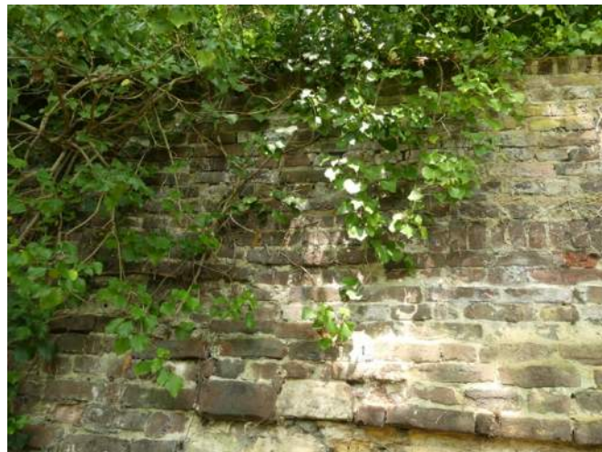
Afb. 11.22.04, afgeschilferde stenen, versleten voegwerk, bijzondere reparaties (vermoedelijk, klampsteen) en forse begroeiing
