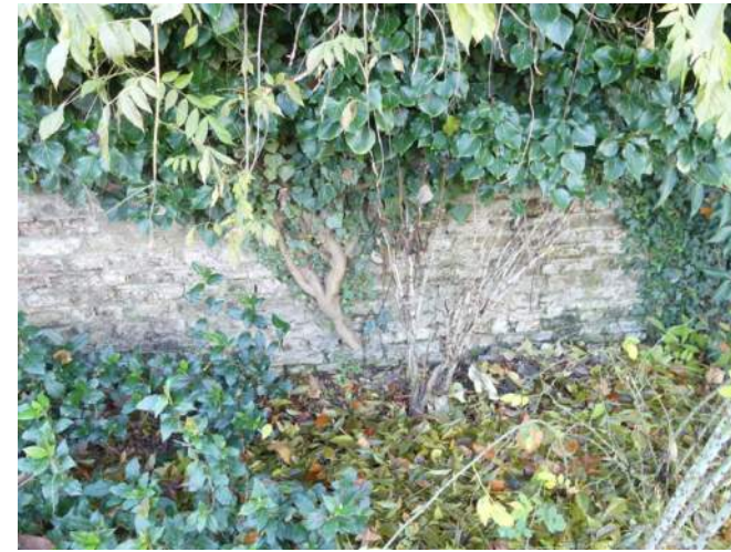
Afb. 06.22.30, klimop met flinke vervuiling
