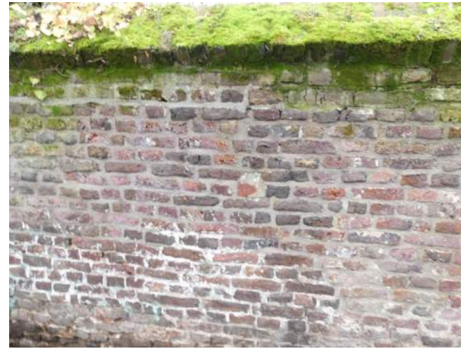
Afb. 10.22.07, slecht voegwerkherstel en forse mosgroei op de ezelsrug
