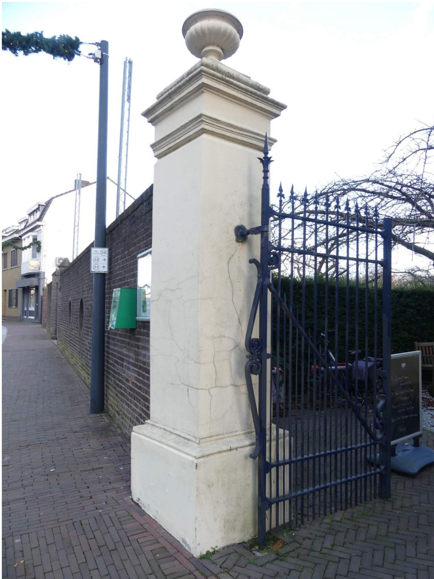
Afb. 06.00.04, detail linkerpenant met scheuren in het pleisterwerk
