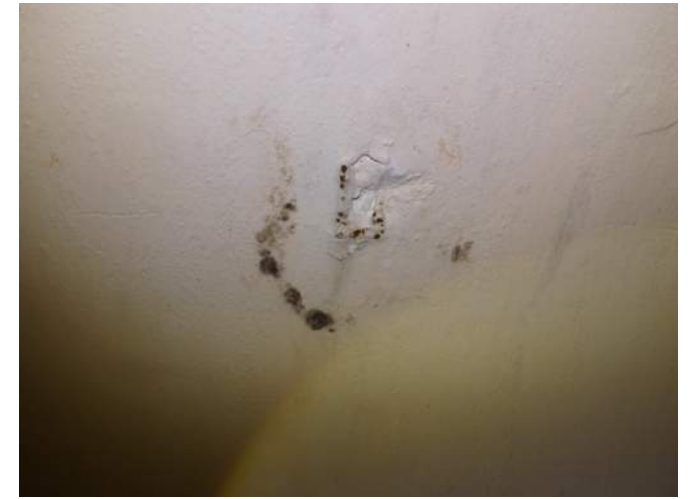
Afb. 12.40.08, roestend ijzerwerk en vervuild pleisterwerk
