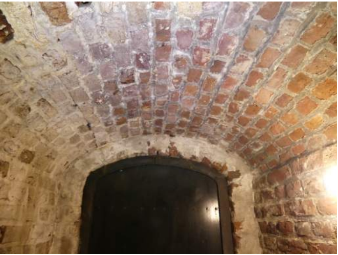
Afb. 12.22.18, gescheurde lintvoeg in gewelf kruitkamer (entreegang)
