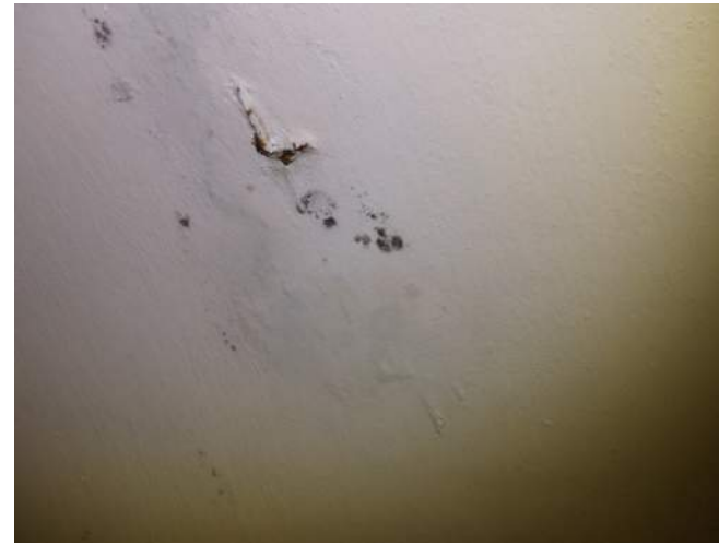
Afb. 12.40.07, roestend ijzerwerk en vervuild pleisterwerk
