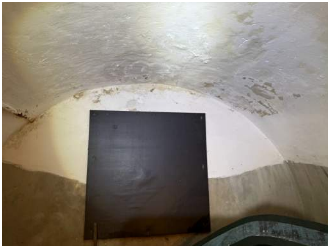
Afb. 12.40.03, beschadigd en afgebladderd gewelfpleisterwerk
