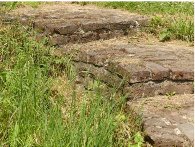
Afb. 12.22.14, uitgevallen voegwerk en begroeiing
