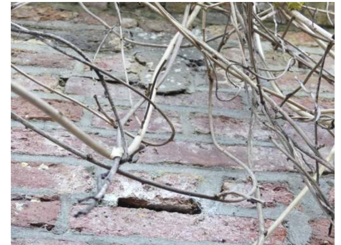
Afb. 06.22.16, uitgevallen en grof, zeer slordig hersteld voegwerk
