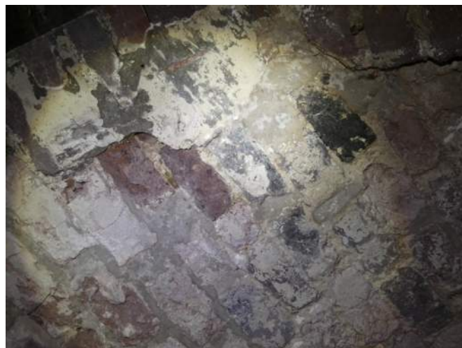
Afb.12.22.24, gescheurd en uitgevallen gewelfvoegwerk
