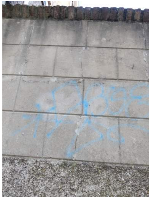
Afb. 06.40.03, verticaal (constructief?) gescheurd en afgebroken stukken pleisterwerk
