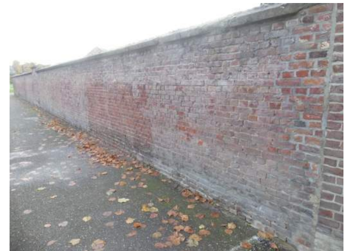
Afb. 08.22.06, foutief hersteld en uitgesleten voegwerk
