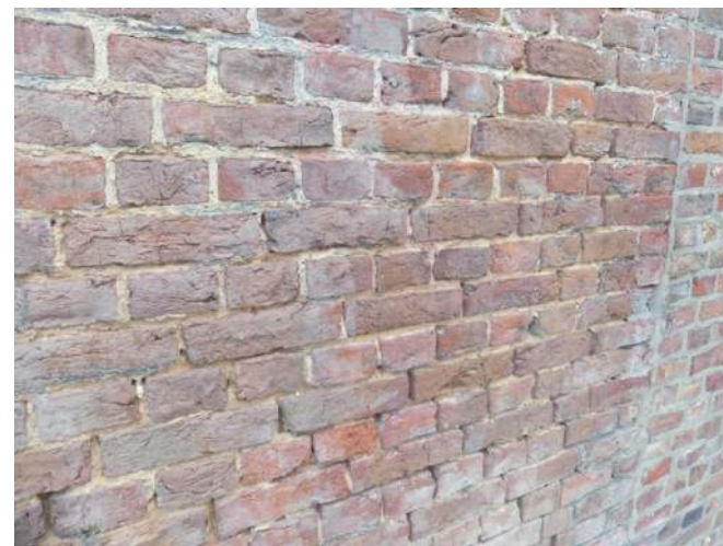
Afb. 08.22.13, uitgesleten voegwerk en slordig herstelwerk
