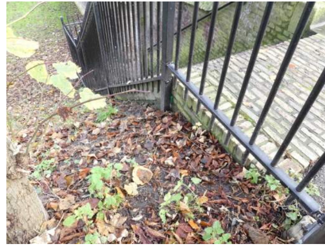
Afb. 05.43.03, slecht gestelde hekwerken
