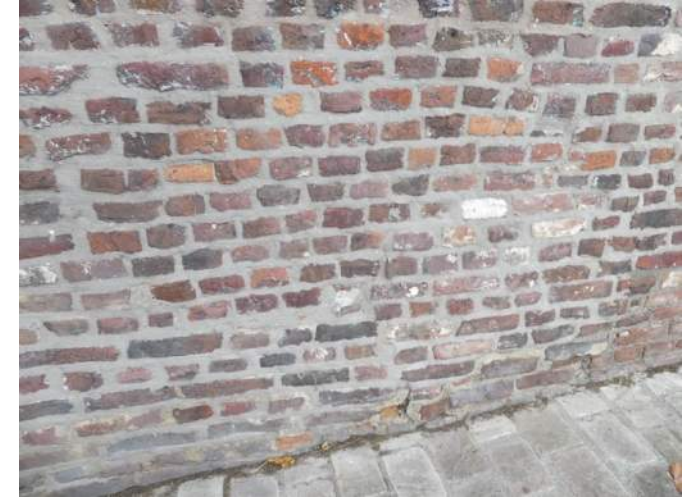
Afb. 10.22.10, foutief hersteld en (weer) losscheurend voegwerk
