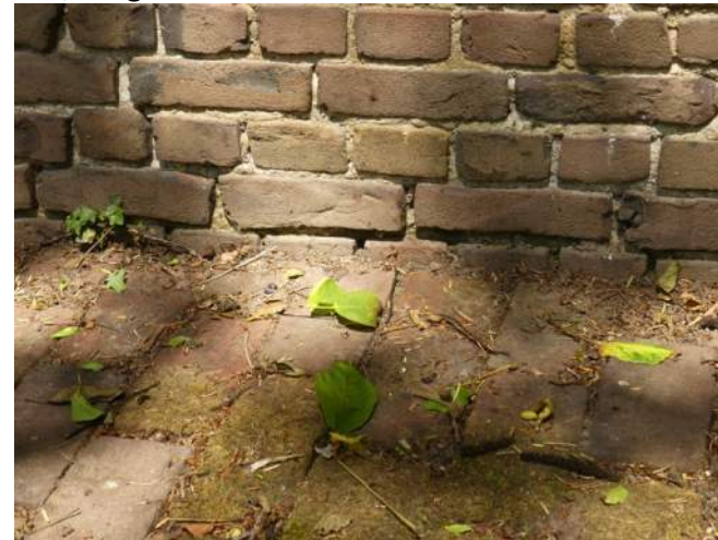
Afb. 11.22.11, diep uitgespoeld voegwerk bij maaiveld
