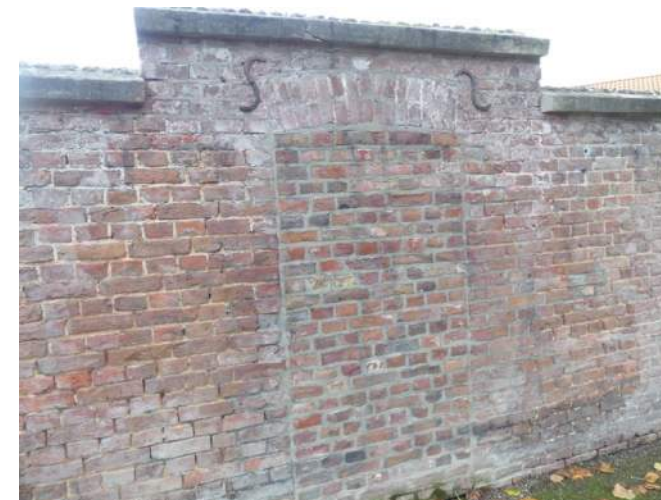
Afb. 08.22.16, versleten voegwerk rondom dichtgezette poort, in de poortvulling detonerend voegwerk
