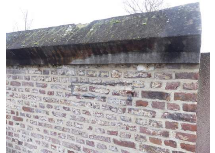
Afb. 05.40.02, beschadigde pleisterwerk afdekkap
