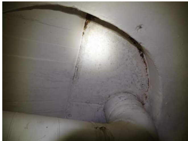
Afb. 12.46.03, beschadigd, afgevalen sauswerk
