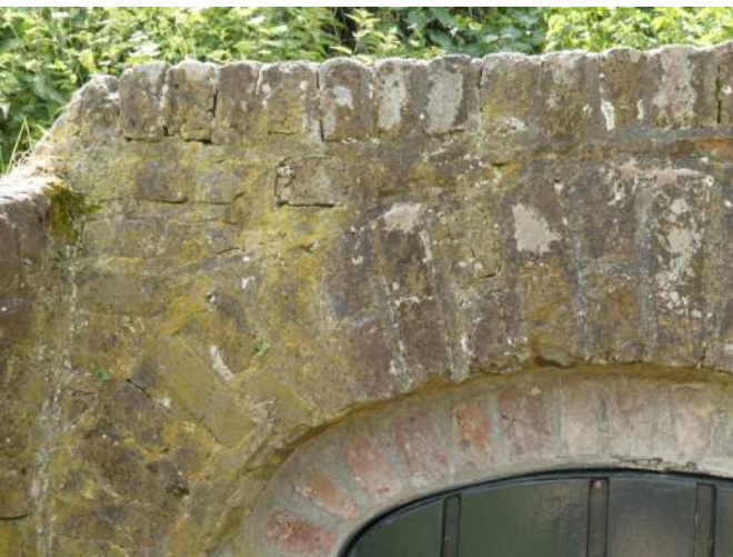
Afb. 05.22.05, scheurtjes in het metselwerk
