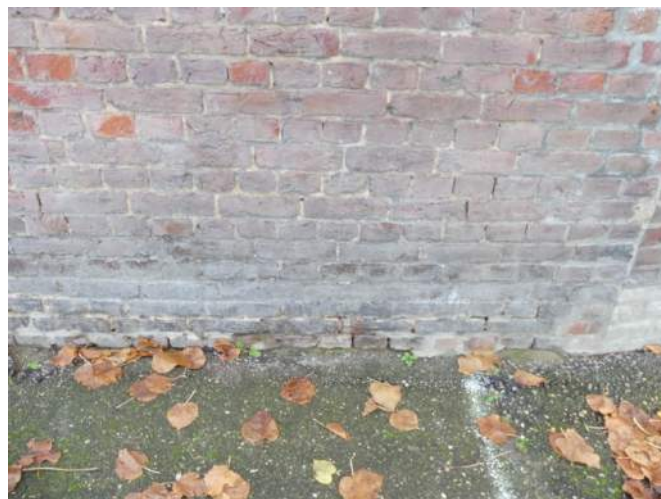
Afb. 08.22.07, uitgespoeld voegwerk bij bestrating
