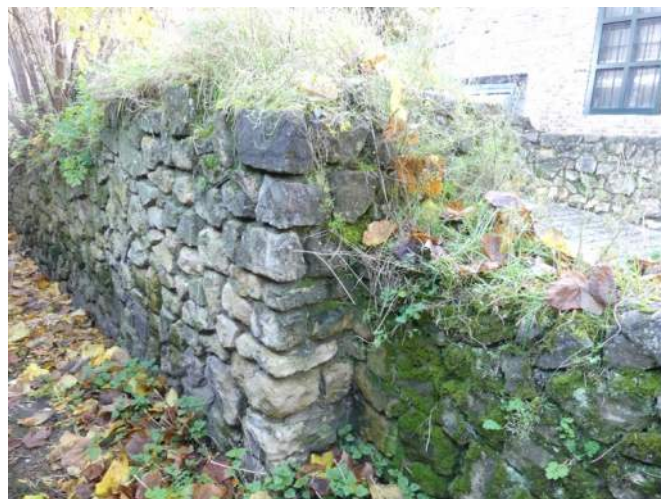
Afb. 07.35.18, uitgesleten en weggefallen voegwerk, alg- en mosgroei en begroeiing
