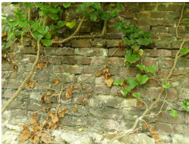
Afb. 11.22.15, versleten en uitgesleten voegwerk, begroeiing
