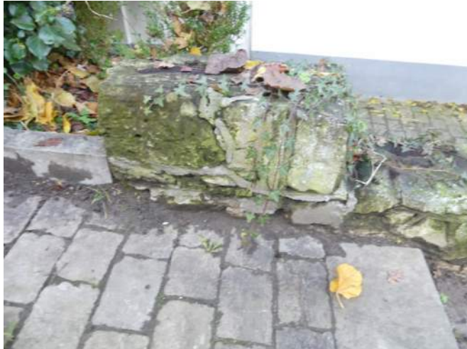
Afb. 05.35.09, slordig hersteld en uitgevallen voegwerk
