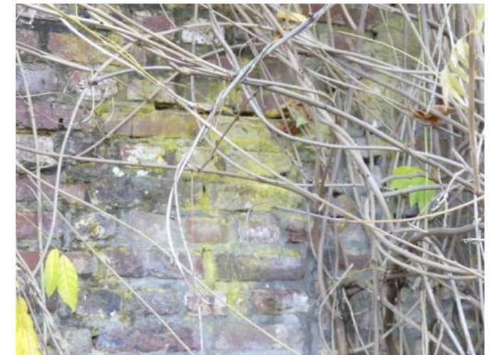
Afb. 06.22.14, loszittend en uitgevallen voegwerk achter begroeiing
