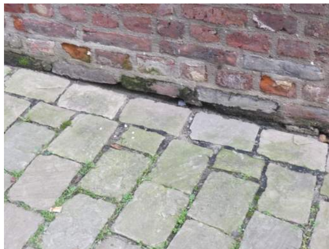
Afb. 08.22.10, uitgespoeld voegwerk bij bestrating
