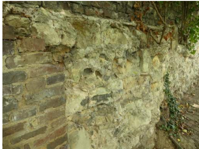
Afb. 11.35.02, gedegradieerd paramentwerk, van nagenoeg alle blokken is de buitenste laag afgesleten/geboerd
