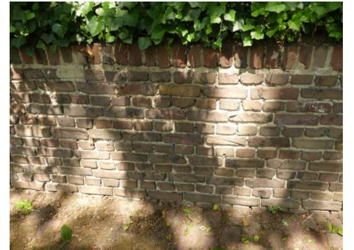
Afb. 11.22.12, uitgesleten voegwerk lage walmuur
