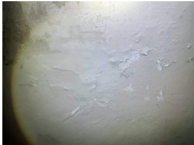
Afb. 12.40.04, beschadigd en afgebladderd gewelfpleisterwerk, enige uitbloei
