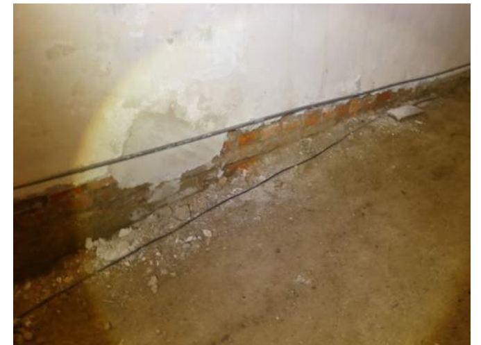
Afb. 12.40.12, beschadigd en afgefallen pleisterwerk
