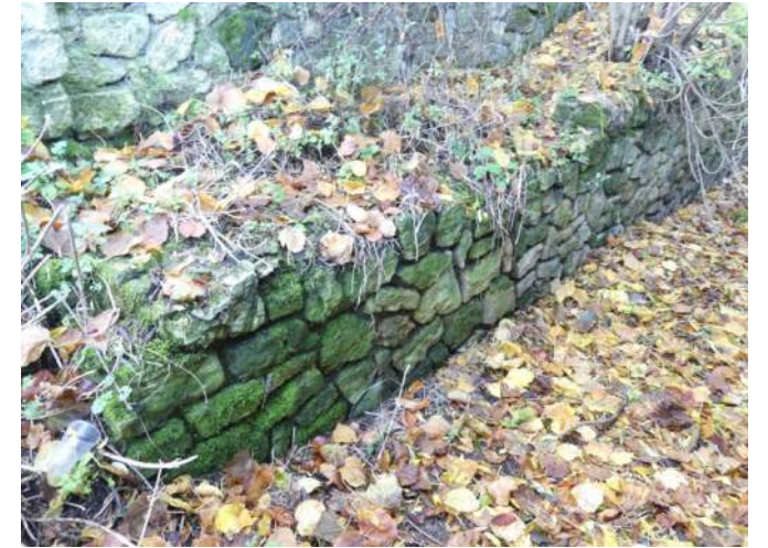
Afb. 07.35.13, uitgesleten voegwerk en alg- en mosgroei
