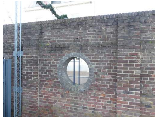
Afb. 06.22.08, vervuild metselwerk en slecht hersteld, weer uitgevallen voegwerk
