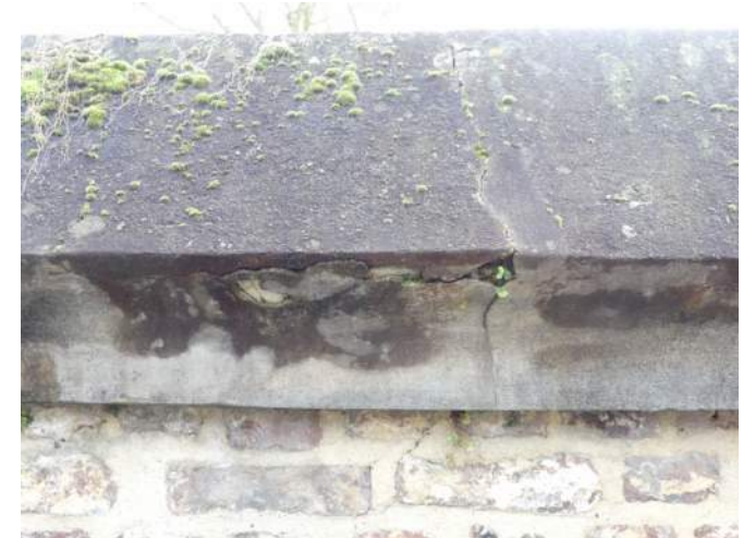
Afb. 05.40.04, losgescheurd (foutief gedetailleerd) 'water-profiel' met vegetatie in loshangende schil
