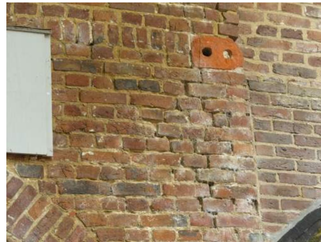
Afb. 11.22.19, diep uitgesleten en loszittend voegwerk
