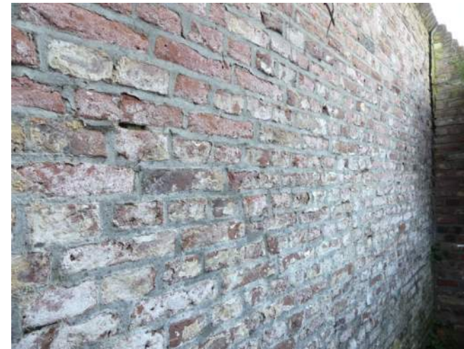
Afb. 06.22.15, te ondiep uitgehaald en weer uitgevallen voegwerk
