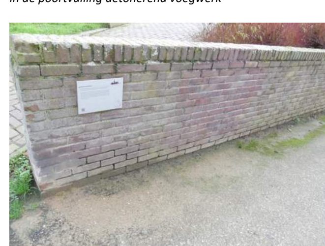
Afb. 08.22.18, uitgespoeld voegwerk en alg- en mosgroei
