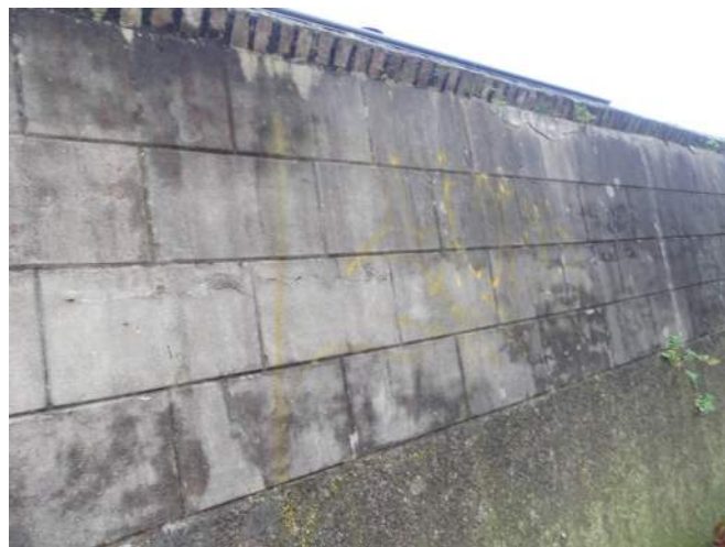
Afb. 06.40.05, gescheurd pleisterwerk en losse schollen
