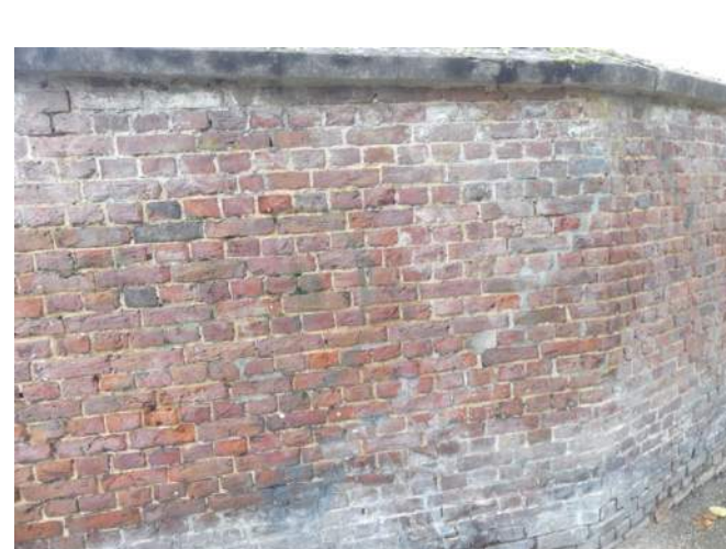
Afb. 08.22.17, uitgesleten voegwerk en foutieve reparaties
