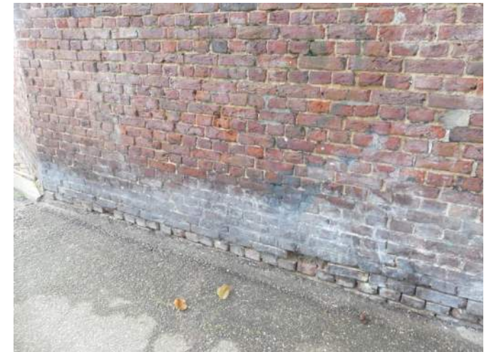
Afb. 08.22.02, kapotte stenen en uitgespoeld voegwerk thv maaiveld
