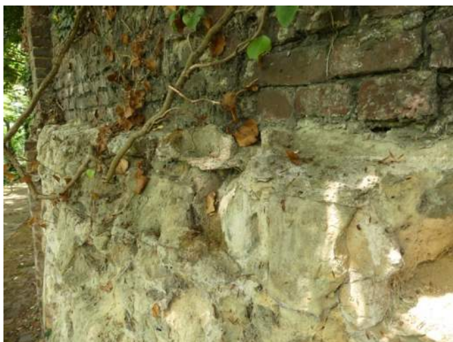
Afb. 11.35.03, baksteen verhoging van natuursteen walmuur, de degradatie van het mergel is duidelijk zichtbaar
