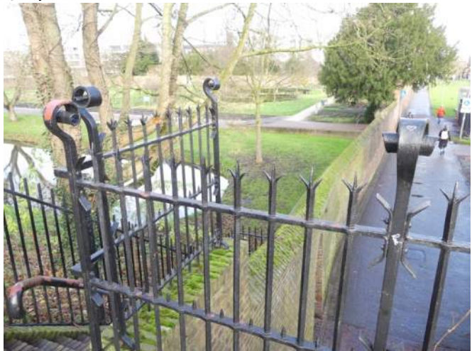
Afb. 05.43.01, verbogen punten, zeskantmoerern, afgebladderde verf
