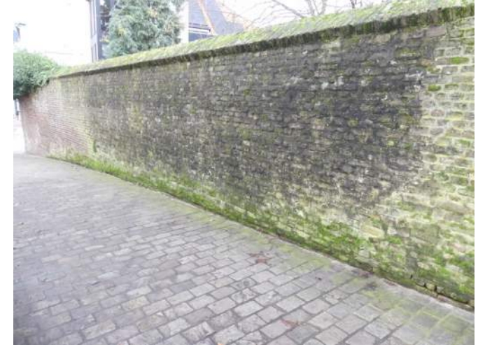
Afb. 10.22.12, zeer vervuild metselwerk en alg- en mosgroei
