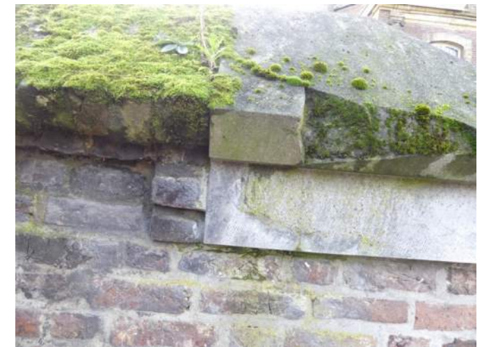
Afb. 05.35.06, afgebroken stuk afdekkap, scheur loopt door
