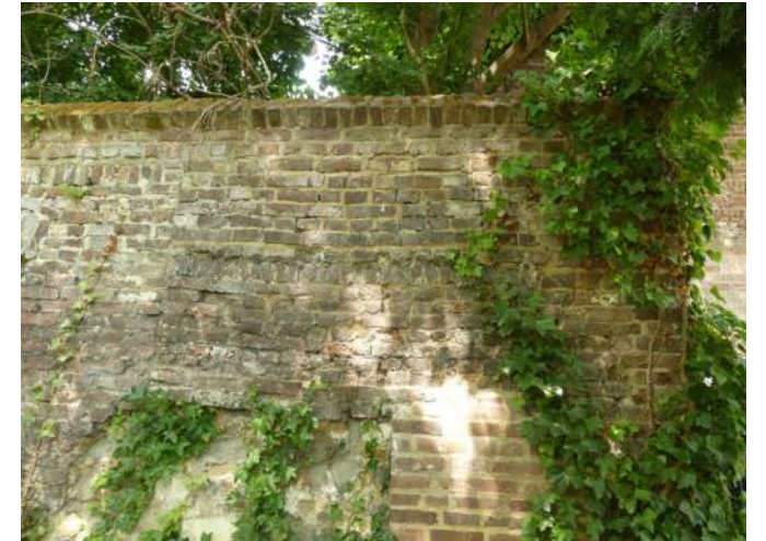
Afb. 11.22.10, gedefformeerd, weggefallen en gescheurd metselwerk
