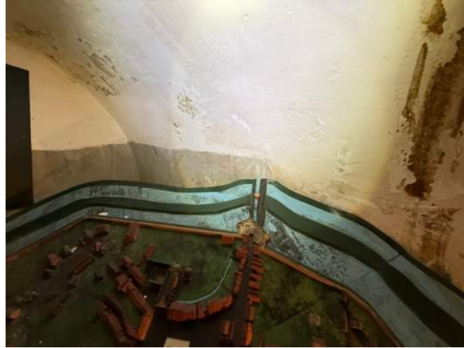
Afb. 12.40.02, beschadigd en afgebladderd gewelfpleisterwerk
