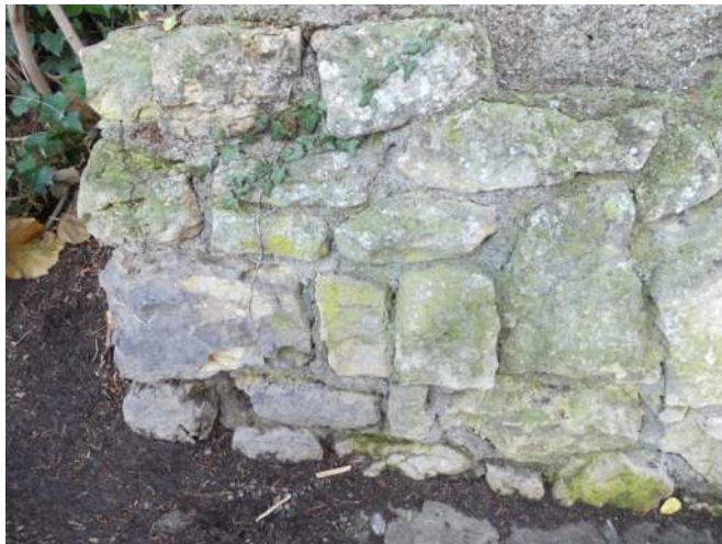
Afb. 07.35.11, ontbrekend blok en losse blokken onderin
