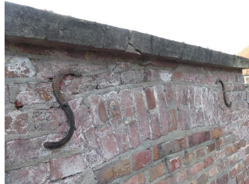
Afb. 08.40.01, beschadigd pleisterwerk van de ezelsrug
