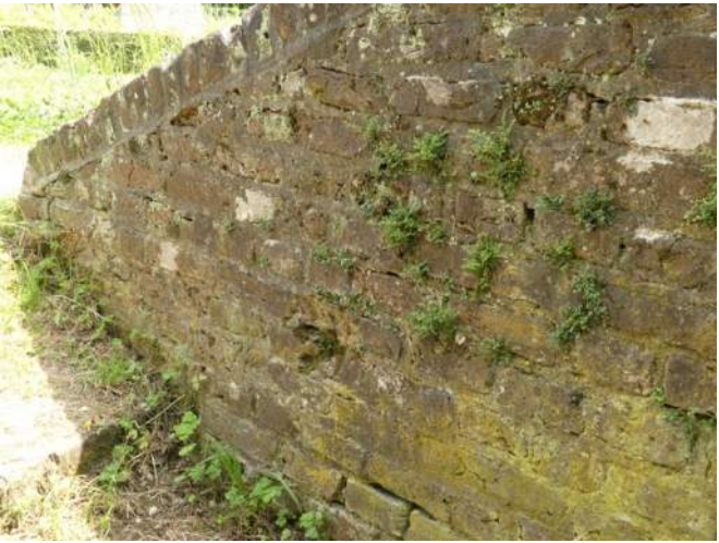
Afb. 12.22.17, uitgevallen voegwerk met algaanslag en inwortelende vegetatie
