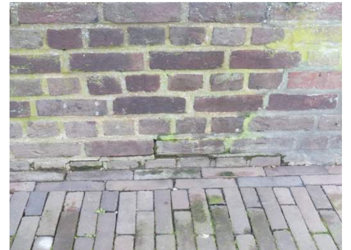
Afb. 06.22.06, uitgespoeld voegwerk bij maaiveld
