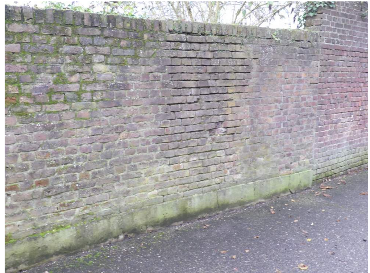
Afb. 09.22.02, uitgevallen voegwerk en alg- en mosgroei
