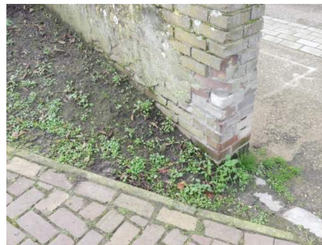
Afb. 08.22.03, beschadigde stenen bij lage walmuur
