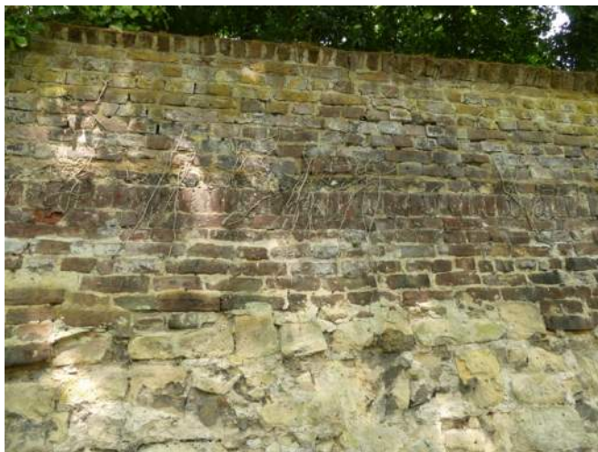
Afb. 11.22.05, gescheurd metselwerk en dode begroeiing
