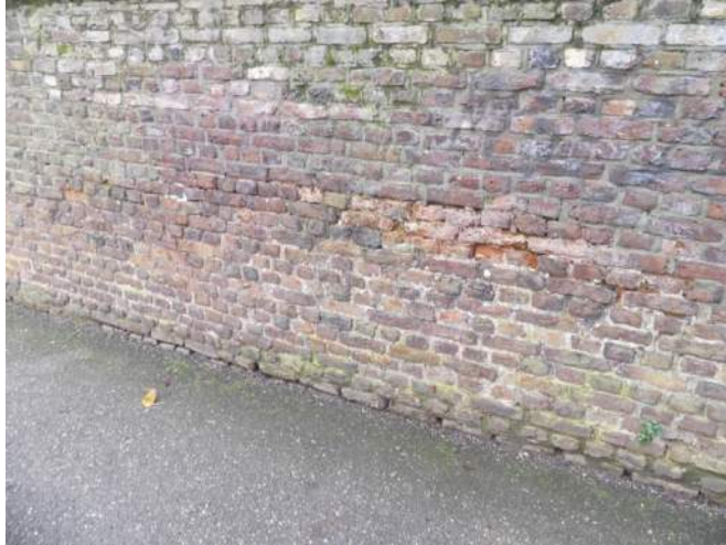
Afb. 10.22.01, afgeschilferde stenen en uitgespoeld voegwerk bij maaiveld
