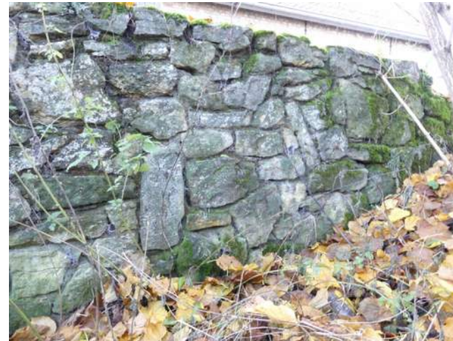
Afb. 07.35.14, uitgevallen, onvoldoende hechtend, voegwerk
