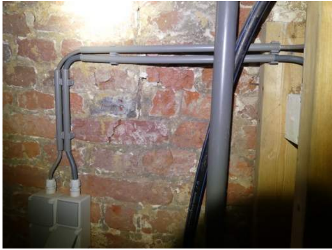
Afb. 05.22.11, scheurtjes in het muurwerk
