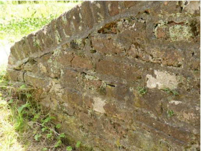
Afb. 12.22.01, kapotte stenen (door te harde voegmortel)
