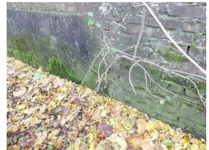
Afb. 06.22.18, loszittend en uitgevallen voegwerk in de plintzone
