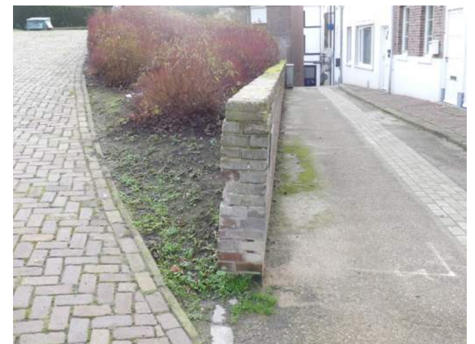
Afb. 08.22.04, beschadigde stenen bij lage walmuur
