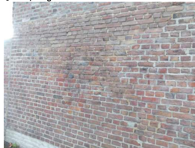
Afb. 08.22.05, verschillende voegtypes en uitgesleten voegen
