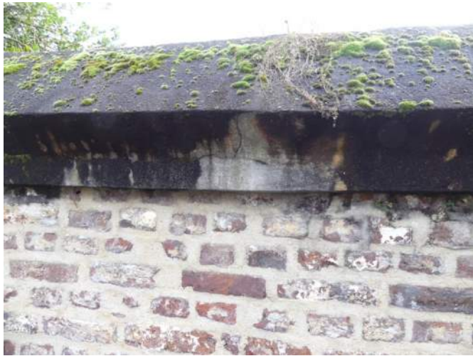
Afb. 05.40.05, gescheurde pleisterwerk afdekkap
