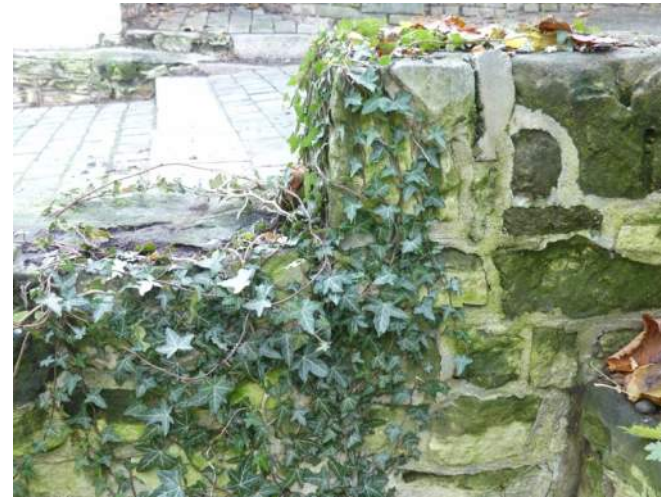
Afb. 05.35.13, slordig hersteld voegwerk
