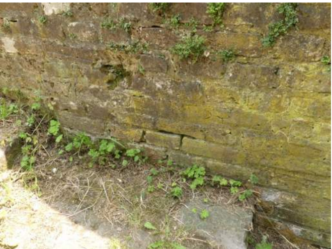
Afb. 05.22.03, kapotte stenen (door te harde voegmortel)
