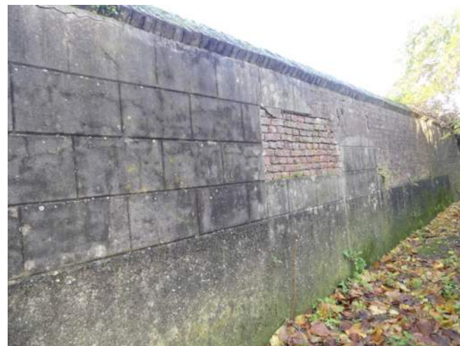
Afb. 06.40.06, afgevalen stukken pleisterwerk
