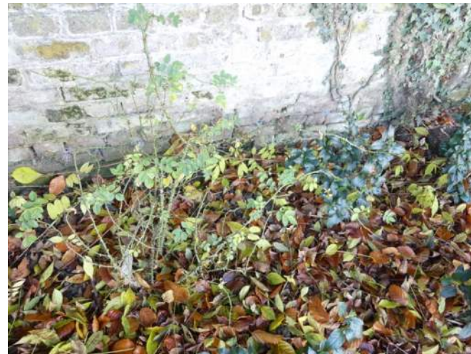
Afb. 06.22.10, uitgespoeld voegwerk thv maaiveld
