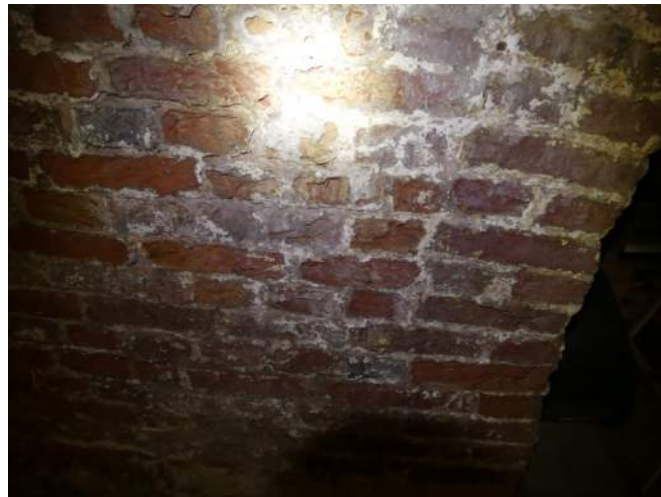
Afb. 12.22.22, verzandend- en uitgevallen gewelfvoegwerk
