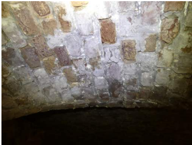
Afb. 12.22.21, uitbloei op gewelfvoegwerk, duidend op vochttransport
