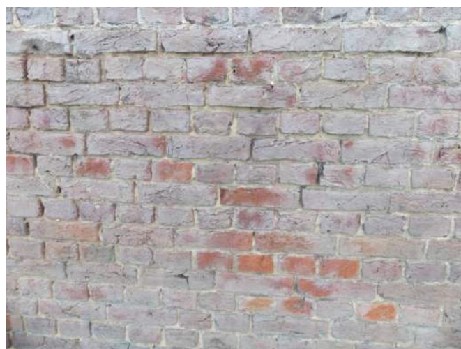
Afb. 08.22.11, uitgesleten voegwerk en gesmet metselwerk
