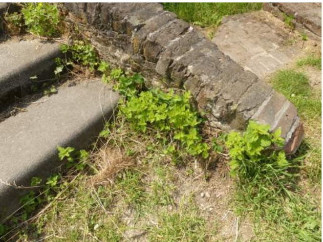
Afb. 05.22.04, kapotte stenen (door te harde voegmortel)
