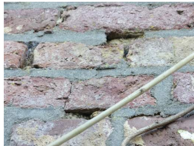
Afb. 06.22.03, gescheurde steen, niet vervangen bij (foutief) voegherstel
