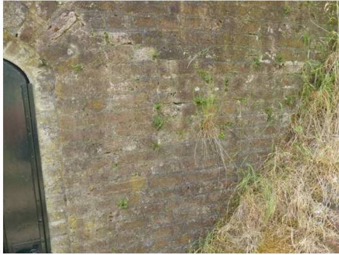
Afb. 12.22.16, gescheurd en uitgevallen voegwerk met alggroei, vegetatie en begroeiing
