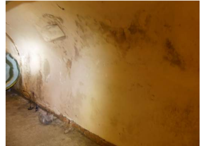
Afb. 12.40.10, beschadigd en verontreinigd pleisterwerk
