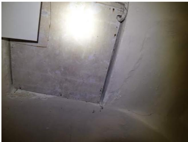
Afb. 12.40.05, gescheurd en beschadigd pleisterwerk
