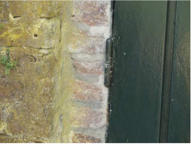
Afb. 12.22.15, gescheurd (roestdruk?) voegwerk en uitgevallen
