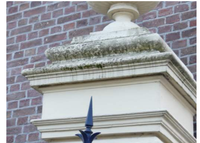
Afb. 06.46.02, sterk vervuild verfwerk op penantkoppen
