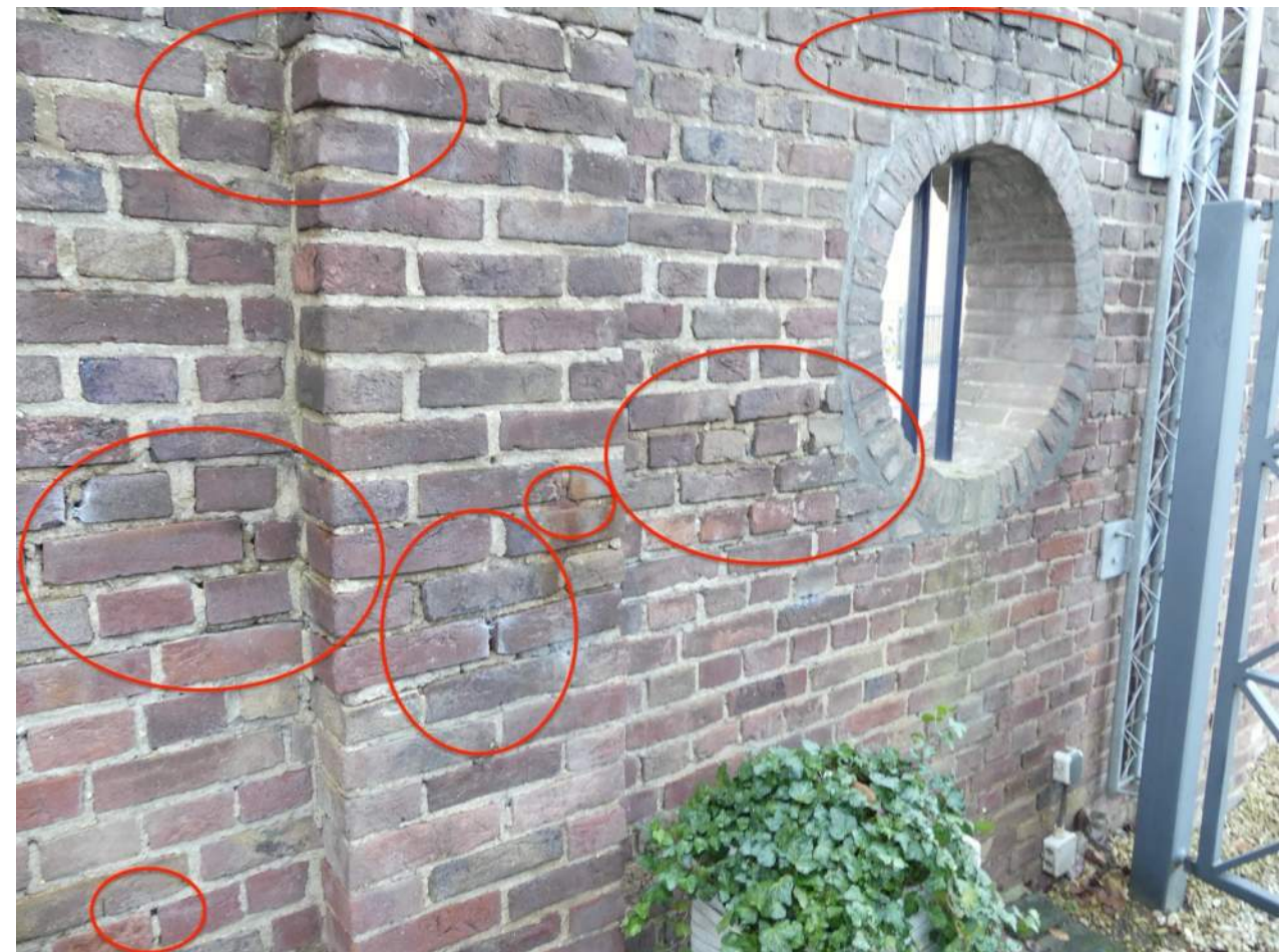
Afb. 06.22.21, slordig en zeer slecht aangebracht voegwerk en schade door roestend ijzerwerk
