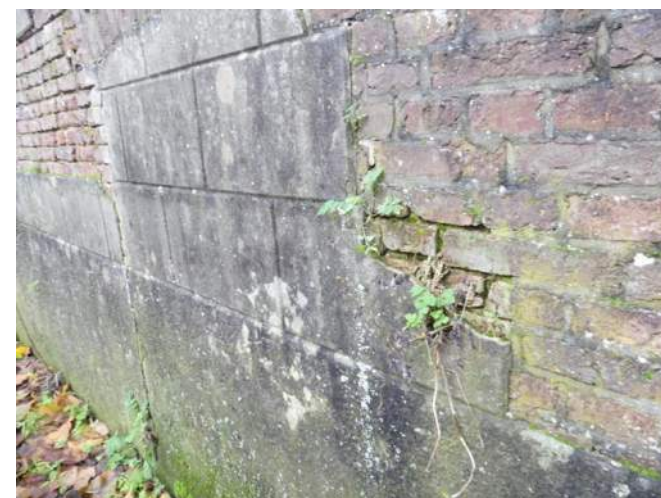
Afb. 06.22.17, uitgespoeld voegwerk tpv weggefallen pleisterwerk
