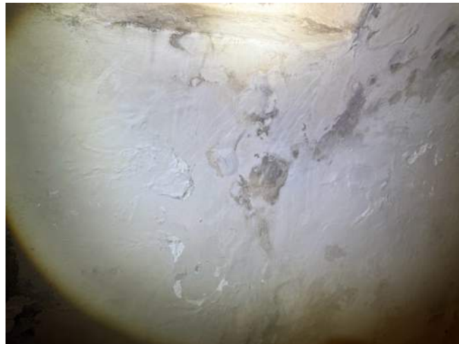
Afb. 12.40.06, beschadigde pleisterwerk afdekkap
