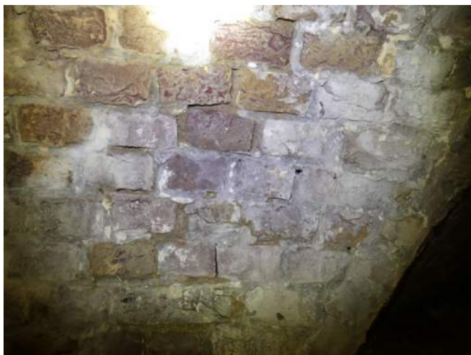
Afb. 12.22.23, verzandend- en uitgevallen gewelfvoegwerk
