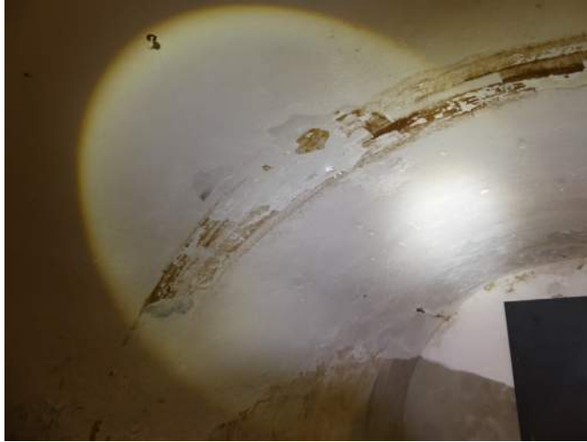
Afb. 12.40.01, vervuild en beschadigd pleisterwerk
