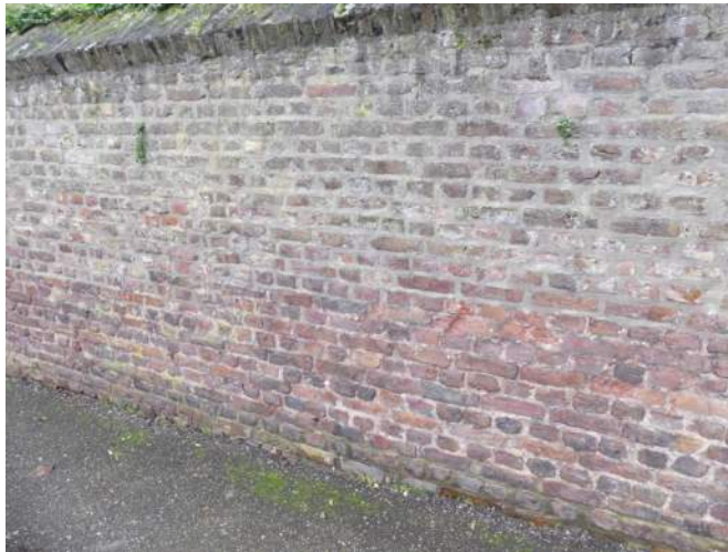
Afb. 10.22.03, afschilferende stenen en uitgespoeld voegwerk bij maaiveld
