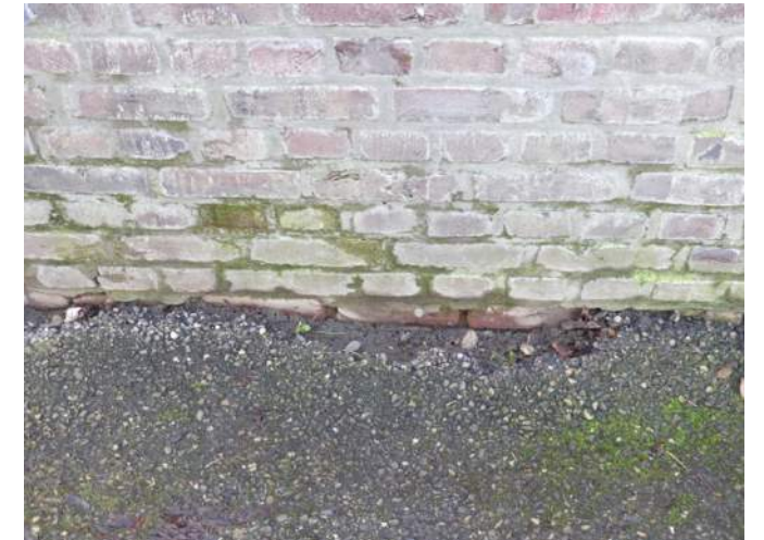
Afb. 05.22.19, uitgespoeld voegwerk bij aansluiting asfalt en met alg- en mosgroei begroeide voegen
