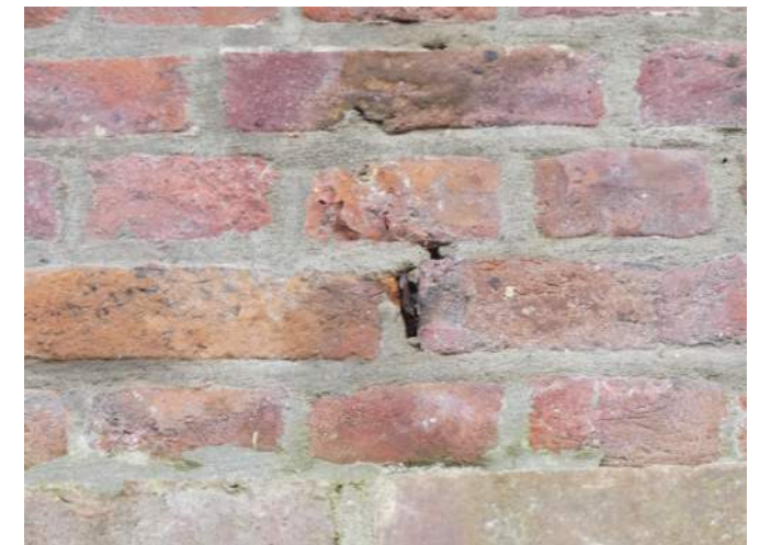
Afb. 05.22.29, slordig kapwerk, steen beschadigd en voeg te breed; door roestend ijzer weer uitgevallen
