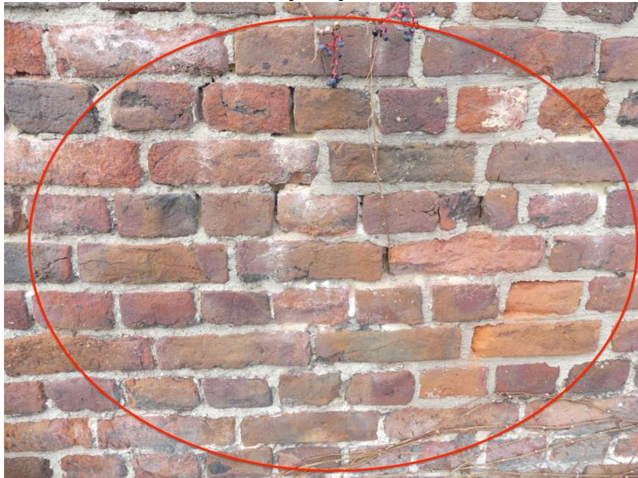
Afb. 04.22.51, onvoldoende diep uitgehaald en weer loszittend en uitvallend, slecht bijpassend voegwerk en -door toepassing van te harde voegmortel verstoorde vochtthuishouding- afschilferende stenen
