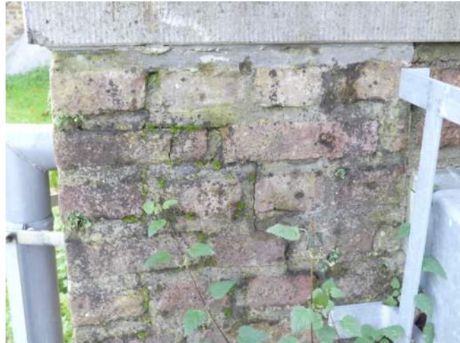
Afb. 04.22.01, gescheurd metselwerk bij doorvoer hwa/afdek
