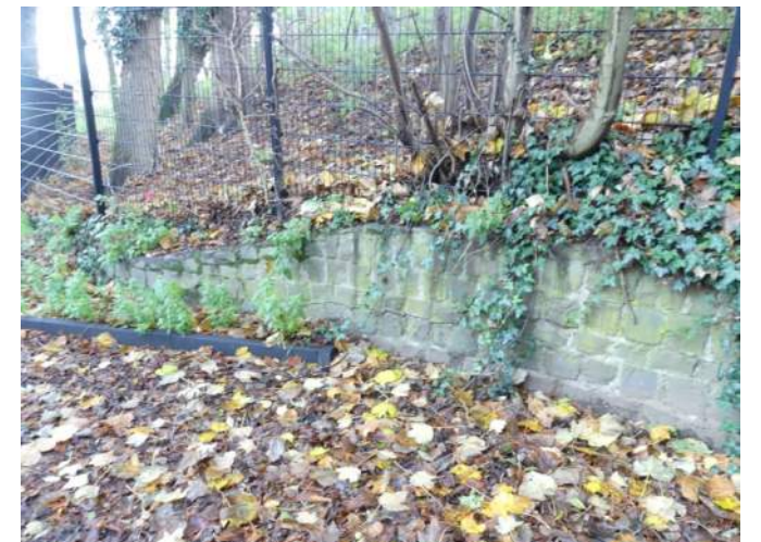
Afb. 01.35.04, gescheurd metselwerk (lengte, afgedrukt?)
