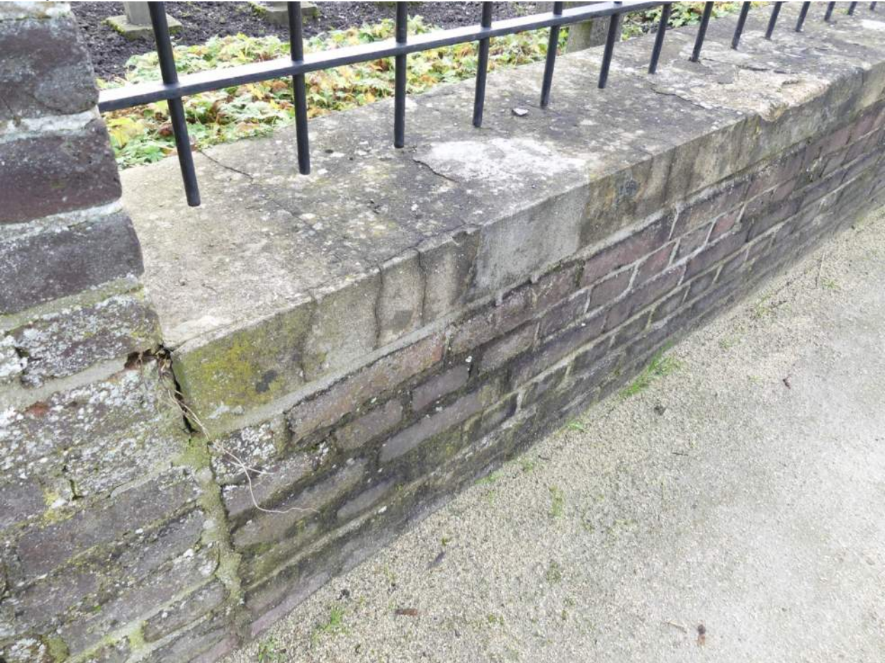
Afb. 04.40.01, gescheurd pleisterwerk op kerkhofmuurtjes Ursulinenkerkhof
