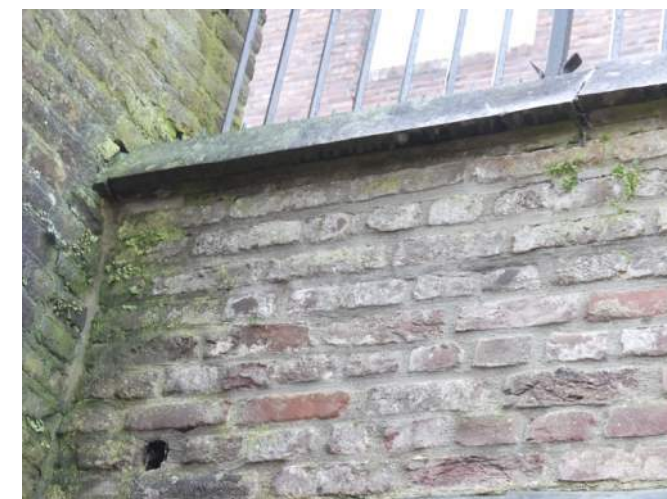
Afb. 04.35.14, slecht gemaatvoerde en gestelde afdek
