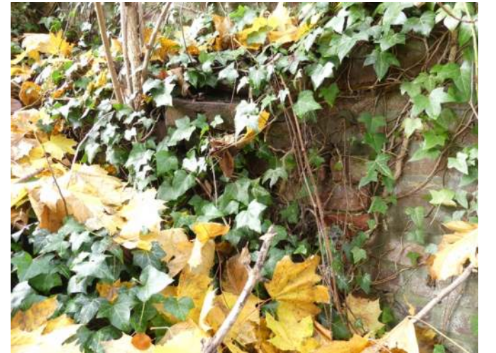
Afb. 05.22.08, gedefformeerd metselwerk onder begroeiing
