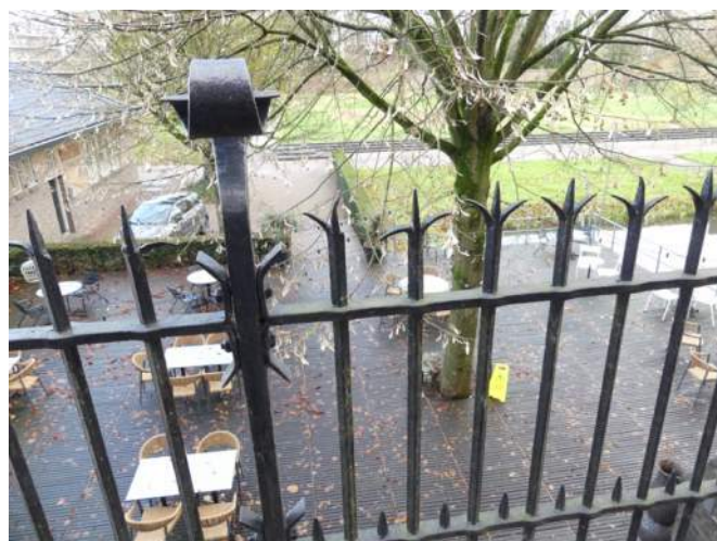
Afb. 04.43.18, verbogen en afgebroken hekwerkpunten
