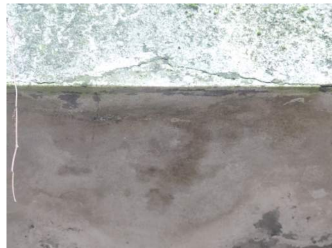
Afb. 05.21.05, haarscheuren in betondek
