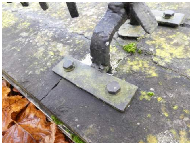
Afb. 04.43.07, scheur door verkeerd boren of roestvorming
