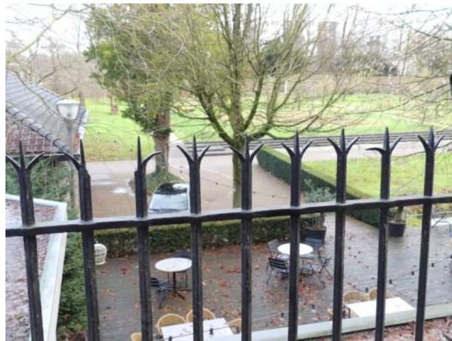
Afb. 04.43.15, verbogen en afgebroken hekwerkpunten
