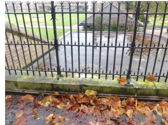
Afb. 04.35.01, overzicht afdekbanden met alg- en mosgroei, links originele bevestiging balustervoet (gietlood), rechts foutief herstellde binnenzijde balustervoet
