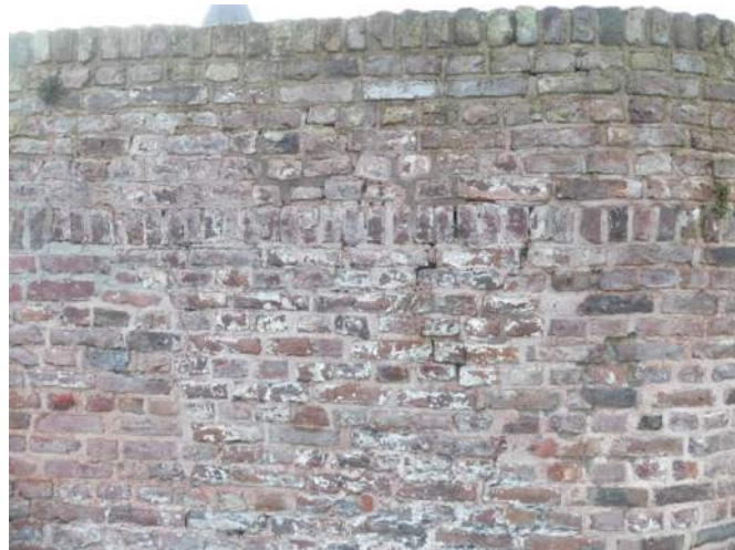
Afb. 03.22.04, beschadigde bakstenen en gescheurd voegwerk
