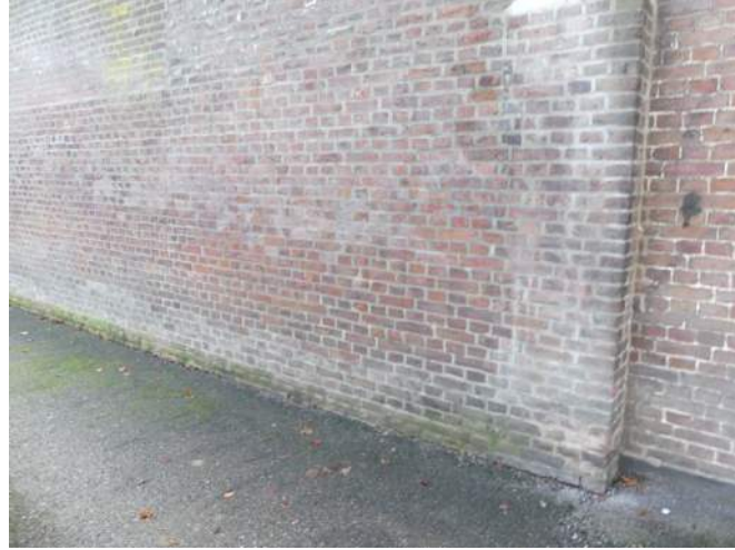
Afb. 05.22.02, gescheurd metselwerk bij verspringing
