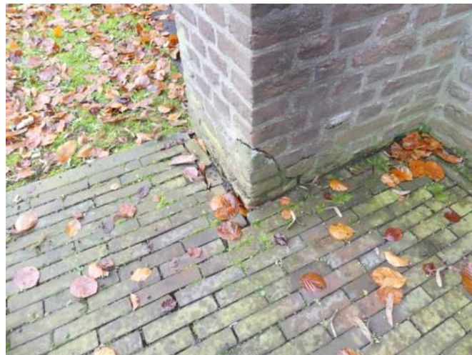
Afb. 04.22.03, gescheurde, vermoedelijk mechanische beschadigde, hoek metselwerk
