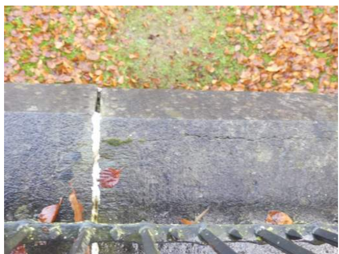
Afb. 04.35.09, losbarstende neus aan de afdek (staand leger??) en slordig kitwerk in naad
