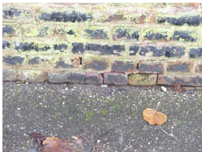
Afb. 03.22.17, ontbrekend voegwerk maaiveld/straatniveau
