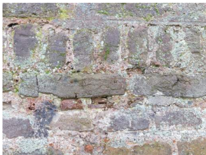
Afb. 03.22.18, loszittend en uitgevallen voegwerk
