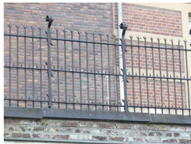
Afb. 04.35.13, slecht gemaatvoerde en gestelde afdekken
