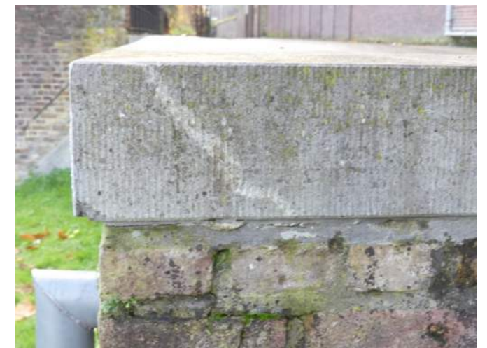
Afb. 04.22.24, slordig afgewerkt met kit afgestreken voegwerk onder afdekken
