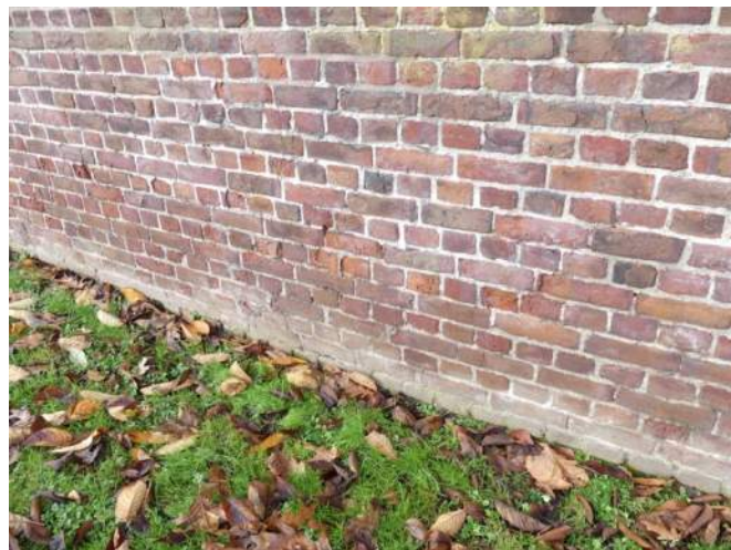
Afb. 04.22.06, afschilferende stenen in oud werk (vermoedelijk zachter gebakken stenen)
