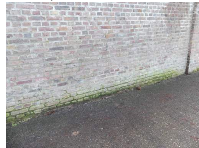
Afb. 05.22.18, uitgespoeld voegwerk bij aansluiting asfalt
