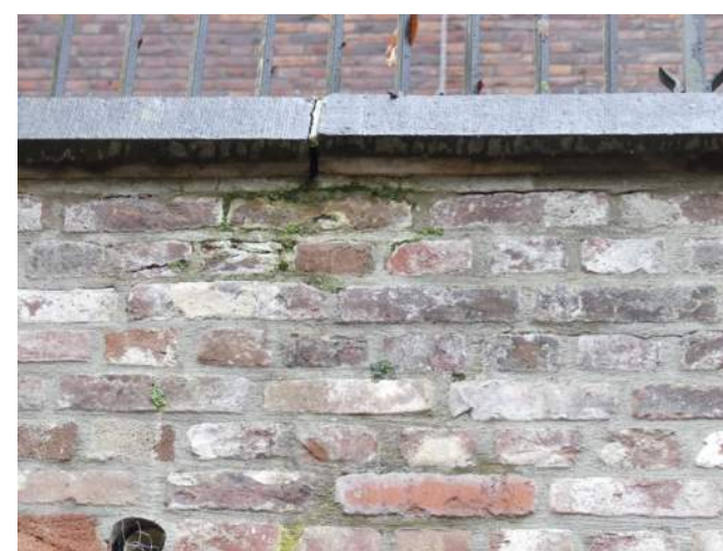
Afb. 04.35.27, losgescheurde mortelvoeg met gevolgschade
