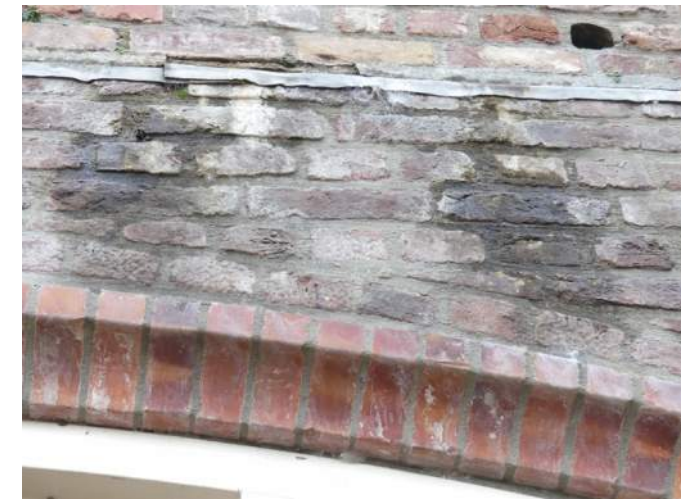
Afb. 04.22.20, actieve lekkage onder muurlood met mosgroei
