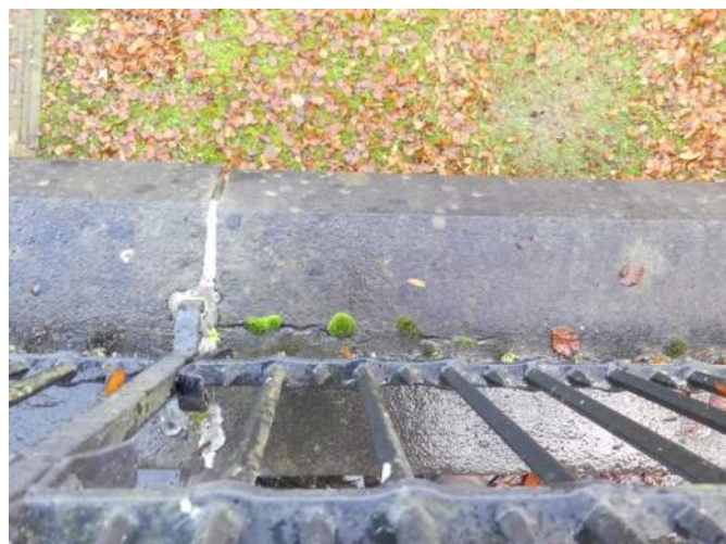
Afb. 04.35.10, losgebarsten neus aan de afdek (staand leger??) en slordig kitwerk in naad
