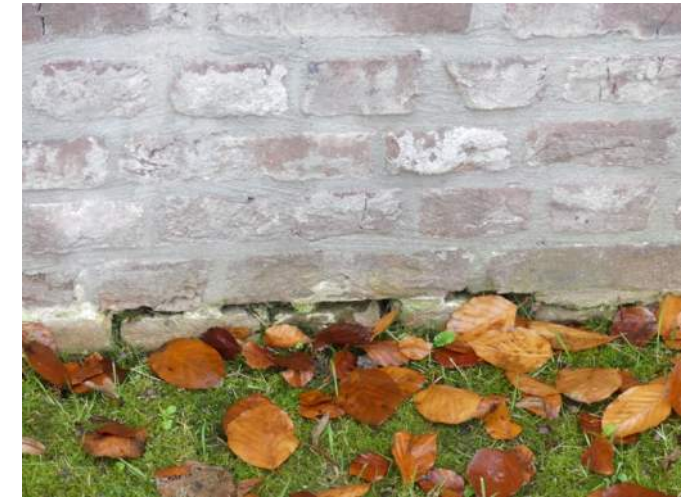
Afb. 04.22.32, uitgespoeld voegwerk maaiveld – mogelijk niet hersteld bij ‘Binnenstadswerken’ in 1993?
