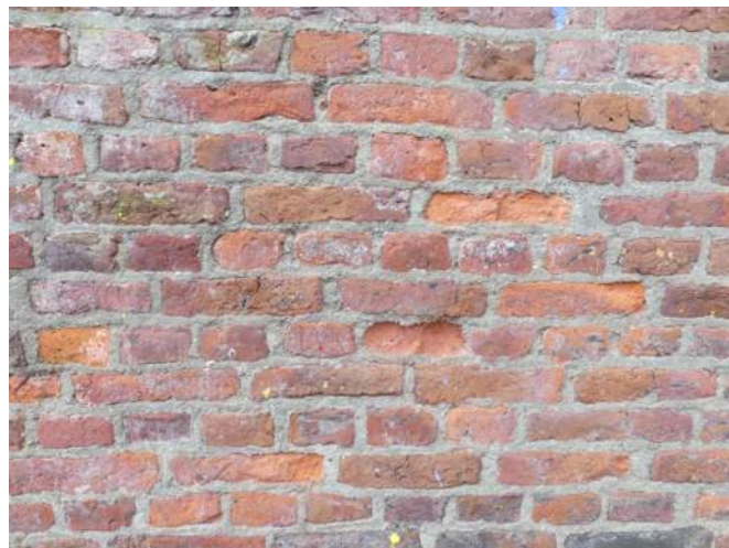
Afb. 04.22.05, afgeschilferde stenen in (vermoedelijk) hersteld voegwerk (mogelijk te harde voegmortel toegepast)
