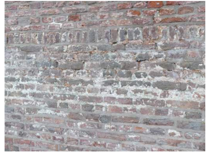
Afb. 03.22.10, overzicht grachtmuur met begroeiing en schade
