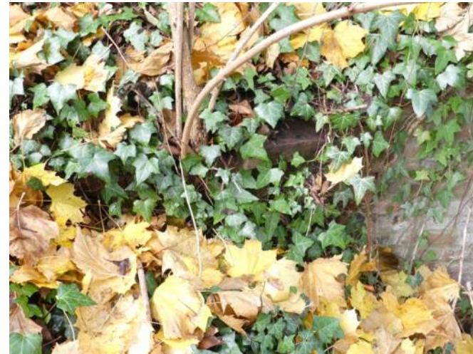
Afb. 05.22.07, gedefformeerd metselwerk onder begroeiing
