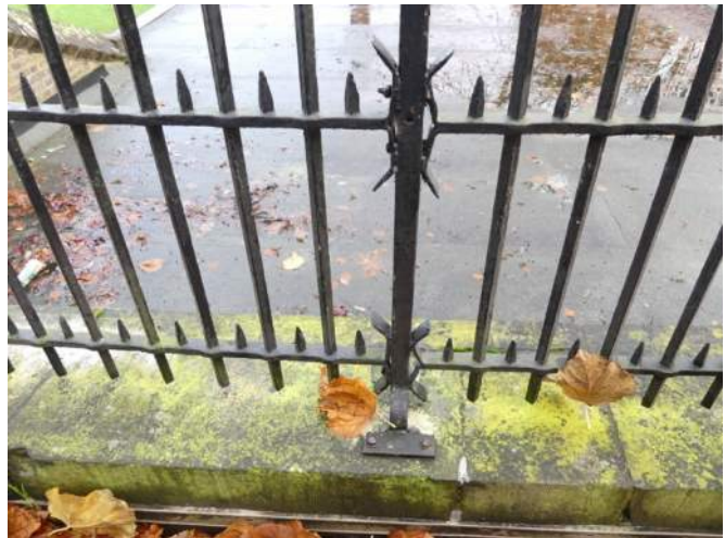
Afb. 04.43.02, vervormde hekwerkbeugels tegen baluster met diverse manieren van bevestigen en foutieve, slordig aangelast voetje met moderne moeren (met roestsporen!)
