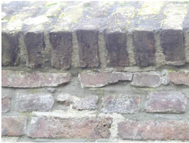
Afb. 04.22.13, scheur onder ezelsrug, kapotte stenen (bij eerder uitgevoerd herstel in situ gebleven)
