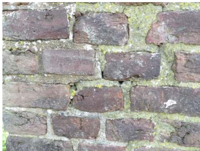
Afb. 04.22.38, cracquelé en uitgevallen voegwerk, discutabele reparaties
