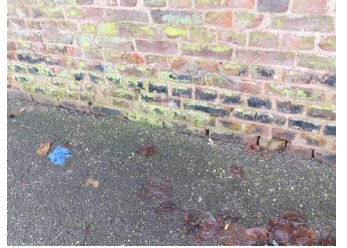
Afb. 03.22.12, ontbrekend voegwerk maaiveld/straatniveau
