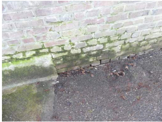
Afb. 05.22.21, met alg bevuilde voegen en uitgespoelde voegen bij aansluiting asfalt
