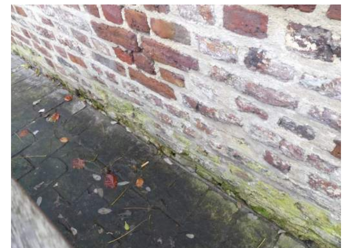
Afb. 05.22.31, uitgespoeld voegwerk en uitgevallen voegen
