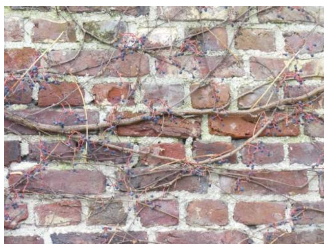
Afb. 04.22.41, foutieve, grofkorrelige reparatievoegen die weer uitvallen
