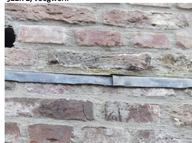
Afb. 04.22.21, losgescheurde voeg boven muurlood, slecht passend herstelwerk
