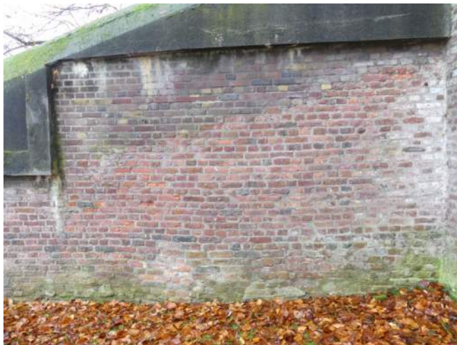
Afb. 04.22.63, kalkuitbloei onder betonnen afdekken
