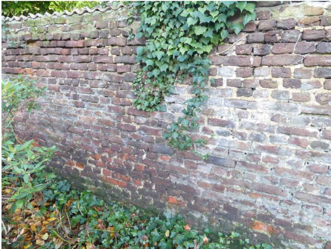
Afb. 05.22.15, uitgevallen voegwerk, kapotte stenen
