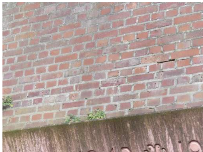
Afb. 05.22.25, loszittend en uitgevallen voegwerk
