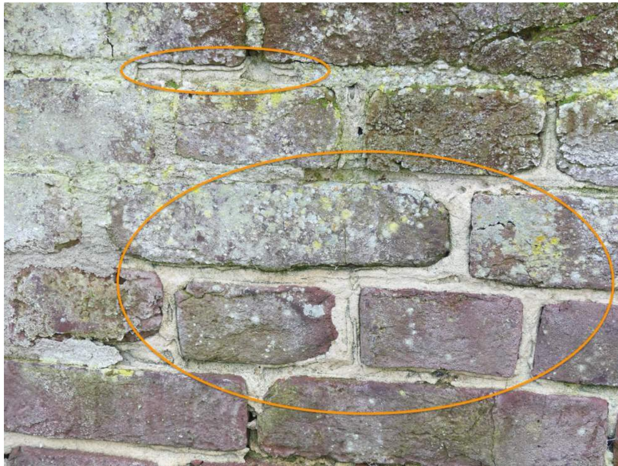
Afb. 04.22.46, redelijk versleten, maar waarschijnlijk origineel voegwerk (goud) naast slecht passende (deel-)reparatie
