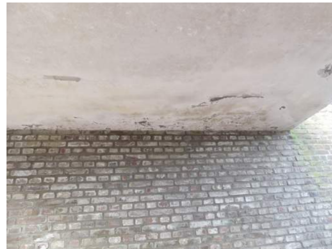
Afb. 05.21.03, onderzijde betondek (richting Ursulinentuin) met lekkageschade tpv aansluiting asfalt op betondek
