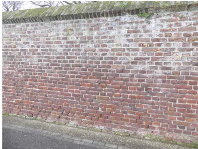
Afb. 04.22.28, door opspattend afdruiwend regenwater uitgespoeld voegwerk in de plintzone
