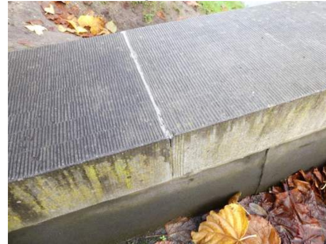
Afb. 04.35.23, slecht gesloten kitvoeg tussen afdekken
