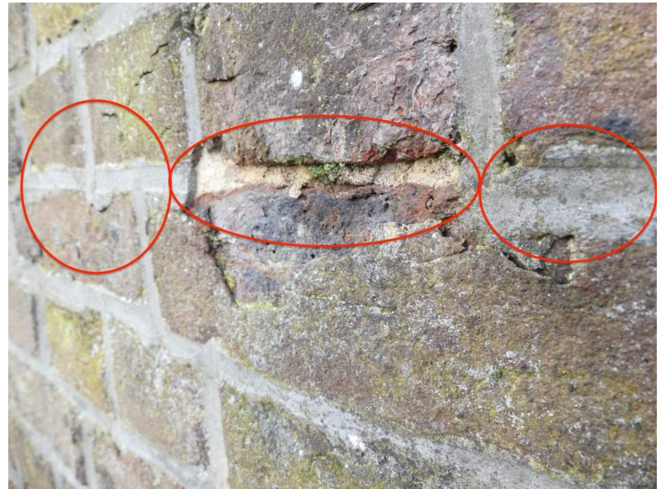
Afb. 04.22.48, volstrekt onvoldoende diep uitgehaald voegwerk ( minder dan 2mm!!! ) en zeer slecht herstelwerk
