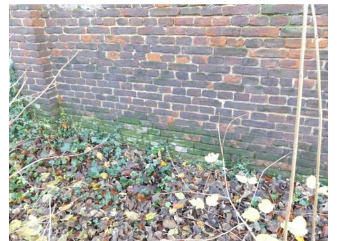
Afb. 05.22.43, uitgesleten en uitgespoeld voegwerk bovenin en bij maaiveld
