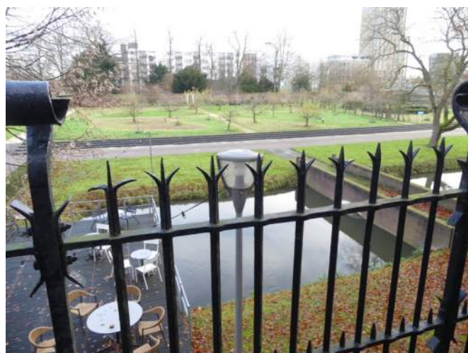
Afb. 04.43.19, verbogen en afgebroken hekwerkpunten
