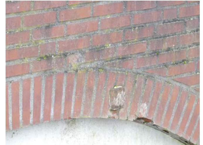
Afb. 04.22.10, alg- en mosgroei, afgebroken stenen
