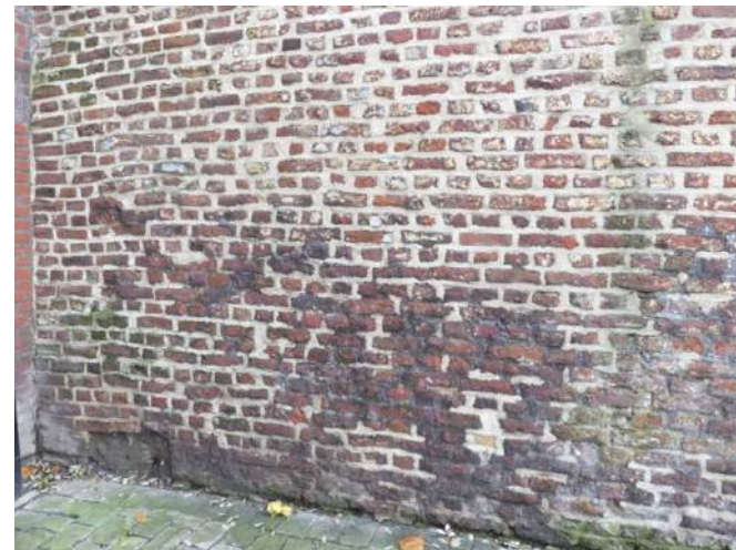
Afb. 05.22.09, lekkagesporen watervoerende scheur
