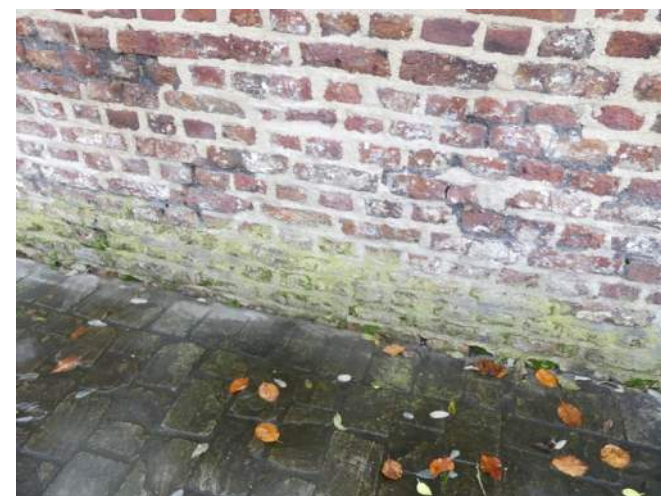
Afb. 05.22.30, uitgespoeld voegwerk plint/maaveld en slordig hersteld voegwerk maaiveld
