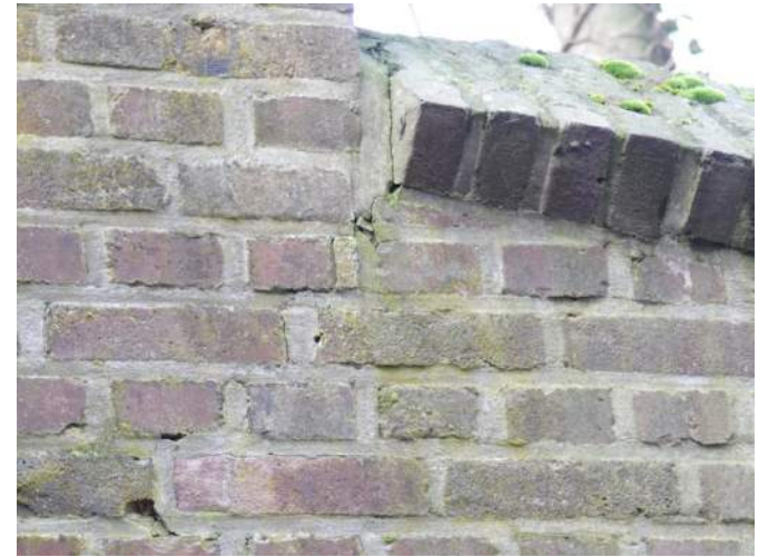
Afb. 05.22.06, gescheurd metselwerk bij verspringing in hoogte
