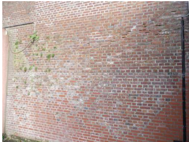
Afb. 05.22.23, met muurvegetatie begroeide en uitgevallen voegen
