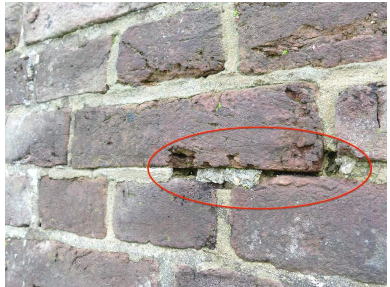
Afb. 04.22.49, onvoldoende diep uitgehaald en weer loszittend en uitvallend voegwerk en -door onkundig uithakken van oud voegwerk- beschadigde stenen
