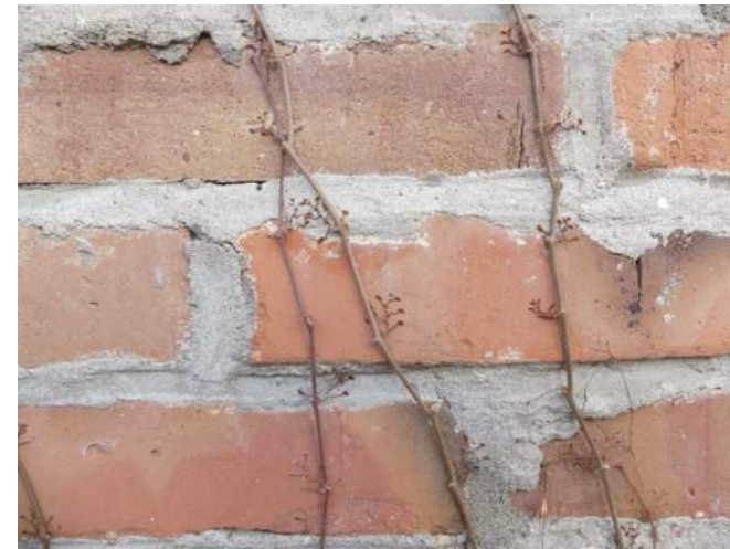
Afb. 05.22.28, slordig aangebracht voegwerk, onregelmatige stootvoegen
