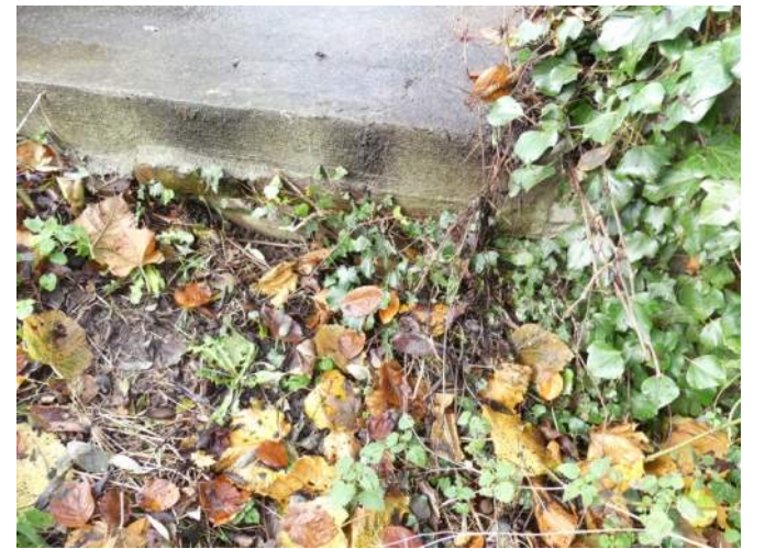
Afb. 05.21.02, uitgezakte, inwaterende bakstenen onder het betondek
