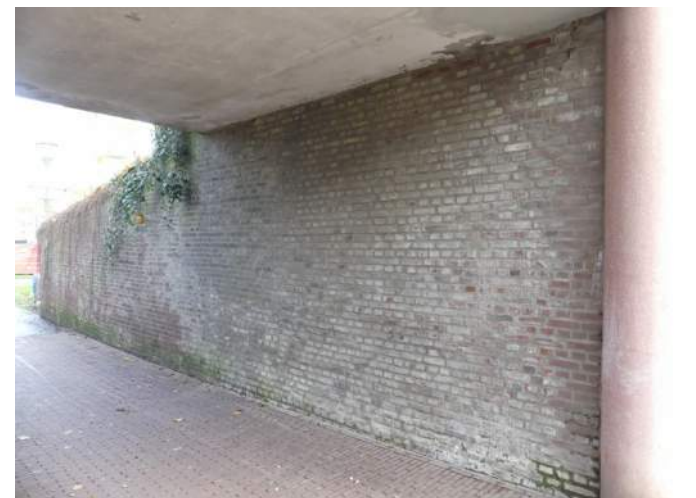
Afb. 05.21.04, onderzijde betondek (richting schootsvelden) met lekkageschade tpv aansluiting asfalt op betondek
