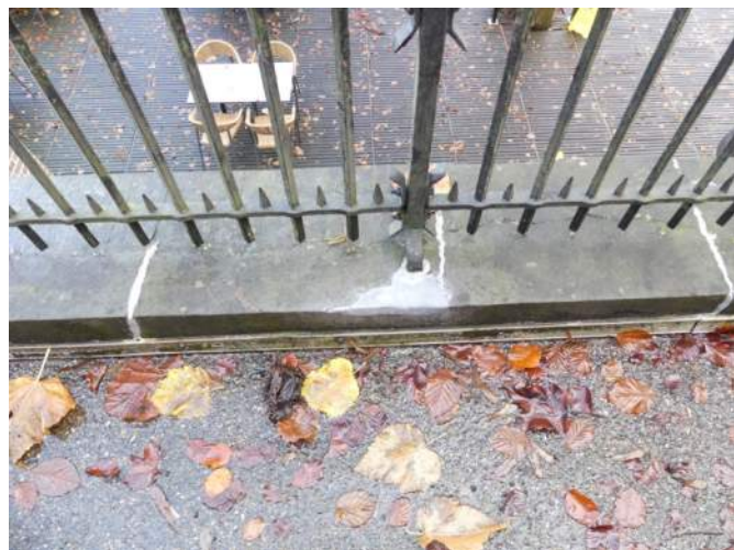
Afb. 04.35.05, bijna volledig gescheurde afdeksteen, (vermoedelijk foutieve mortelreparatie, slordig kitwerk in naden en herstelde scheur
