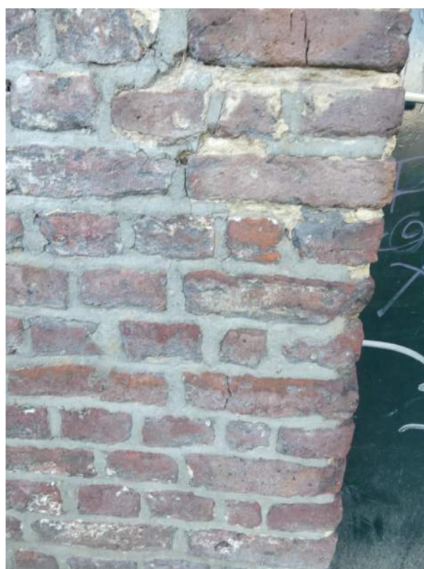
Afb. 05.22.49, detonerende en slordig aangebracht voegwerk
