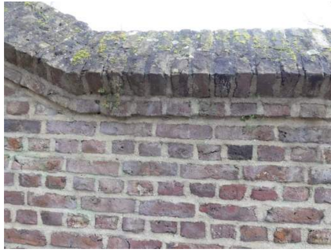
Afb. 05.22.33, alg- en mosgroei en uitgespoeld voegwerk uit ezelsrug
