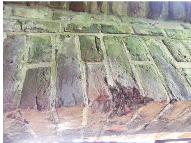
Afb. 04.22.18, beschadigde stenen onder rollaag
