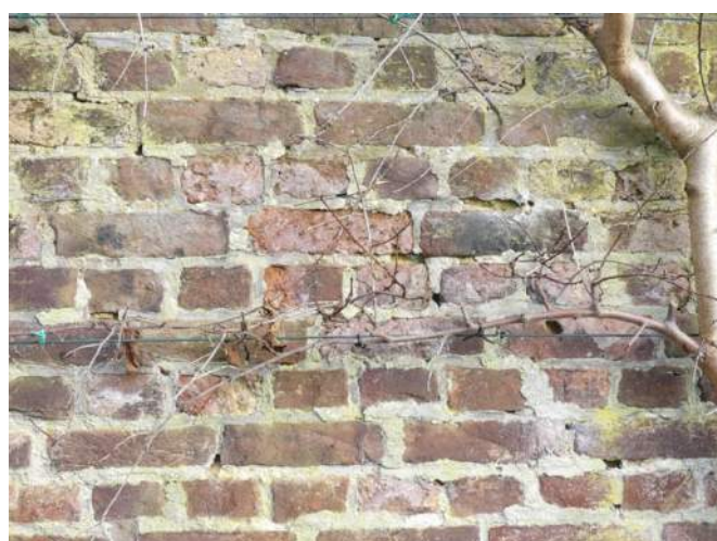
Afb. 04.22.42, slecht gerepareerd en (weer?) uitgevallen voegwerk – NB: let op kleur legmortel
