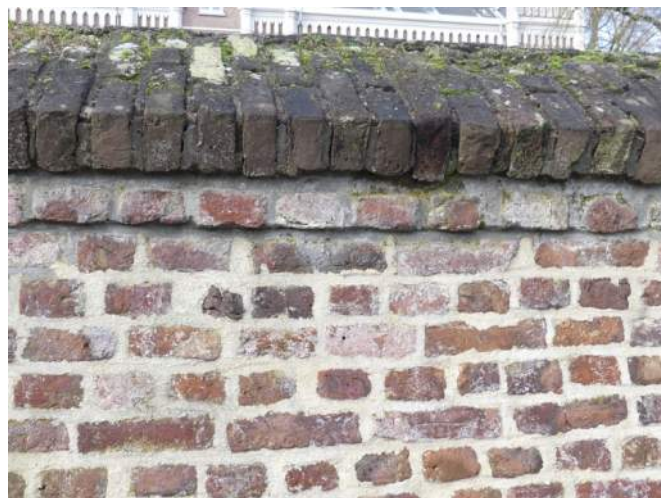
Afb. 05.22.37, alg- en mosgroei en uitgespoeld voegwerk uit ezelsrug
