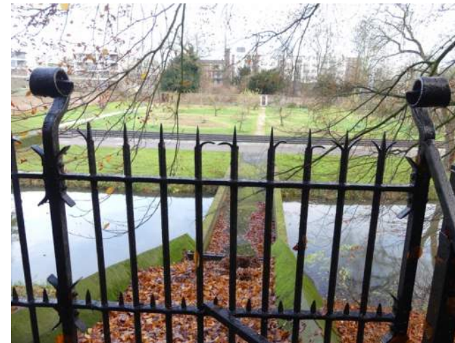
Afb. 04.43.21, verbogen en afgebroken hekwerkpunten
