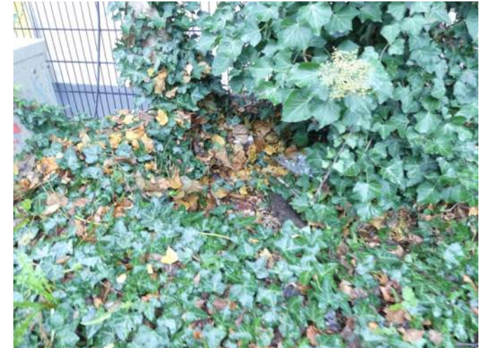
Afb. 01.35.02, (vermoedelijk) losliggend en/of weggevalen metselwerk
