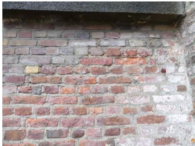
Afb. 04.22.04, afgeschilferde steen, cementsluier over (mogelijk) hersteld werk
