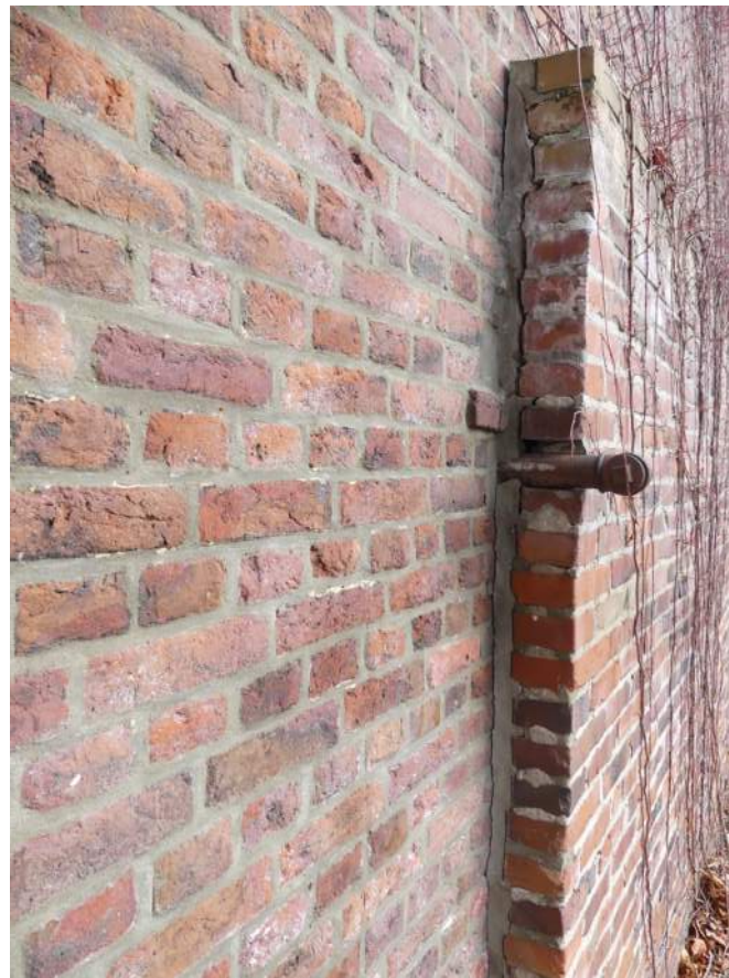
Afb. 05.22.04, losgescheurd verdikkend metselwerk
