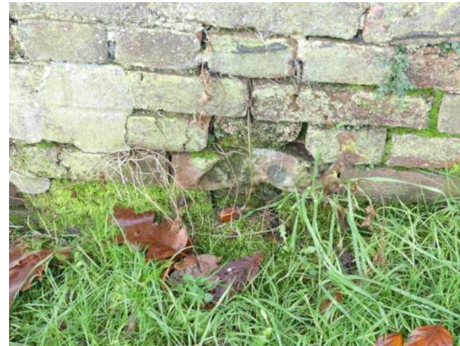
Afb. 04.22.07, beschadigde steen thv maaiveld, uitgespoeld voegwerk
