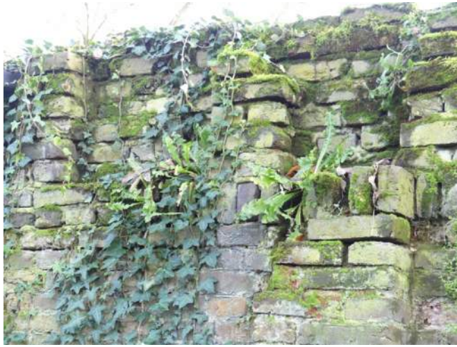
Afb. 05.22.11, losliggend metselwerk bovenzijde muur
