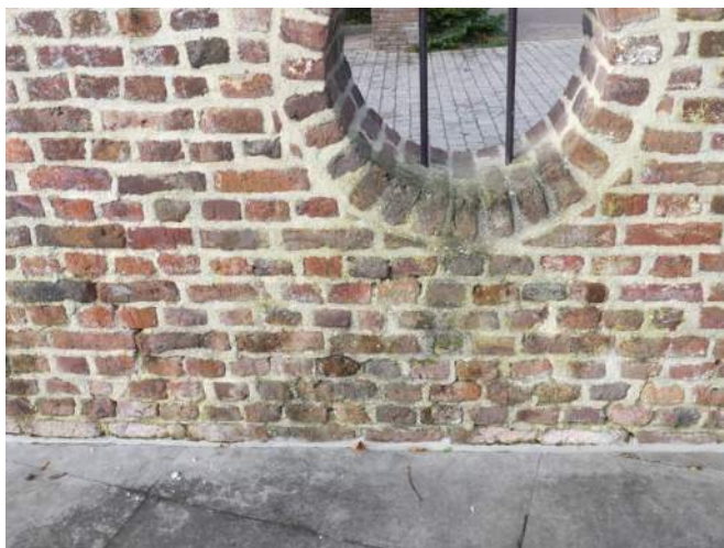
Afb. 05.22.36, slordig hersteld voegwerk en uitgevallen voegen
