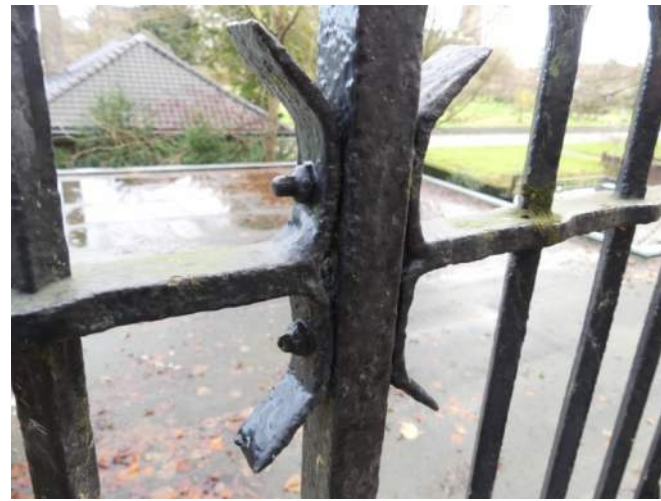
Afb. 04.43.04, ....zeskantmoeren aan baluster bevestigd; in casu moderne, niet passende bevestigingsmiddelen op historisch hekwerk
