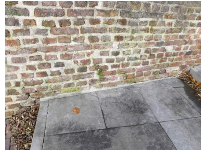
Afb. 05.22.38, slecht hersteld voegwerk, te brede stootvoegen en (weer?) uitgevallen voegen – te ondiep uitgehaald
