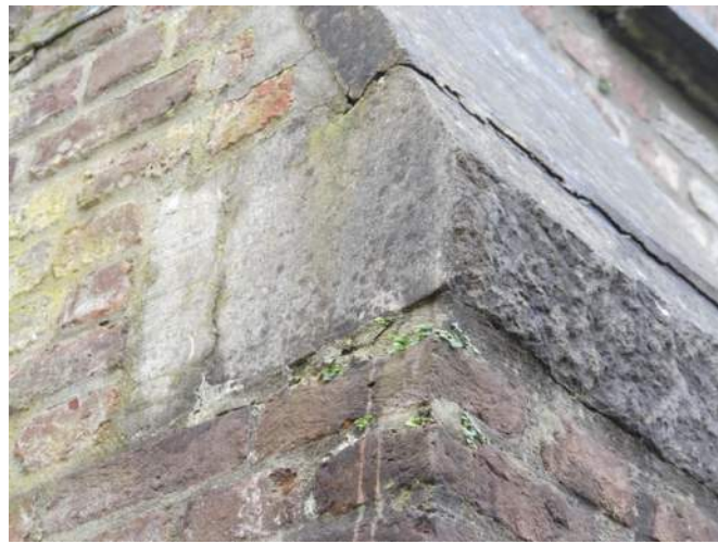
Afb. 04.35.18, barst in lijf afzaatblok penant en losgebarsten voeg met afzaatplaat
