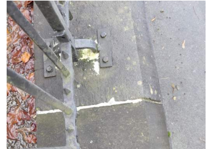
Afb. 04.35.24, slecht aangebrachte kitvoeg: schuine mortelvoeg is losgescheurd
