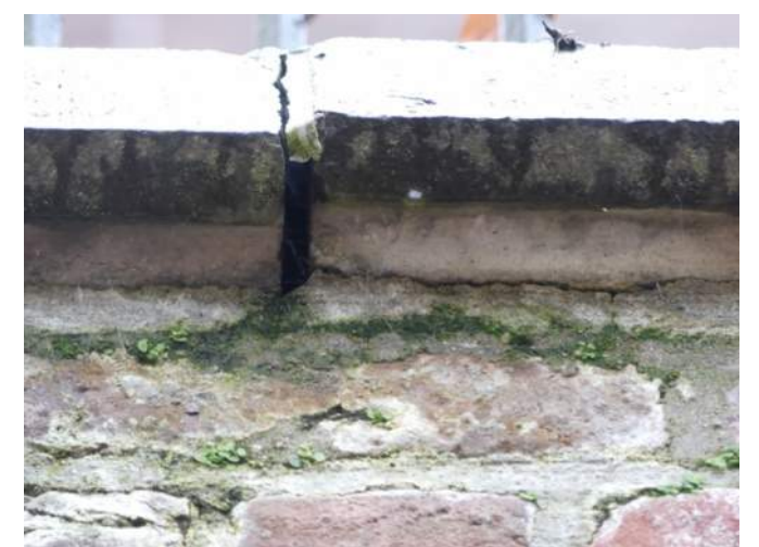
Afb. 04.35.28, detail gevolgschade: alg- en mosgroei en lekkage
