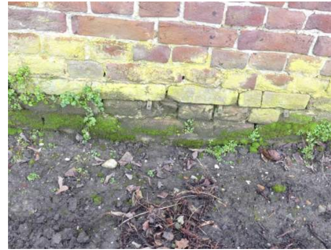
Afb. 04.22.31, uitgespoeld voegwerk plint/maaveld
