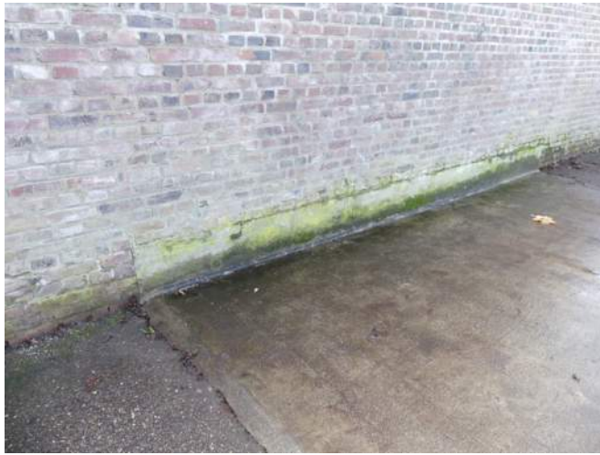
Afb. 05.22.20, met alg bevuilde voegen, net boven betonbalk
