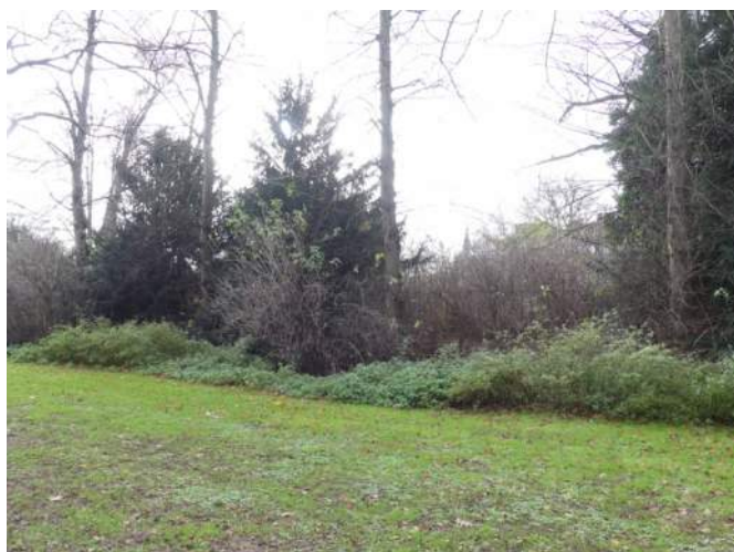
Afb. 04.16.03, door plantsoen onbereikbare muur, hierdoor geen onderhoud op te nemen of uit te voeren
