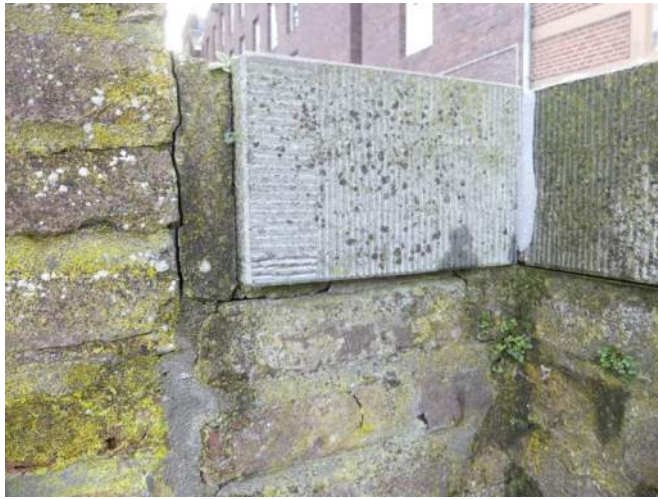
Afb. 04.22.25, losgescheurd voegwerk onder/naast afdekken
