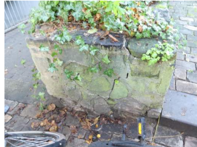
Afb. 01.35.01, gescheurd metselwerk (hoek, mechanisch?)
