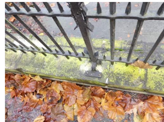
Afb. 04.35.03, foutieve (binnenzijde) bevestiging balustervoet, mechanische beschadiging, gescheurde neus met mosgroei, slordig kitwerk
