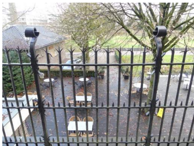
Afb. 04.43.17, verbogen en afgebroken hekwerkpunten
