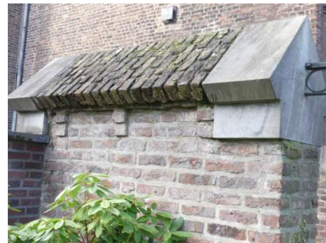
Afb. 05.22.40, uitgespoeld voegwerk uit ezelsrug
