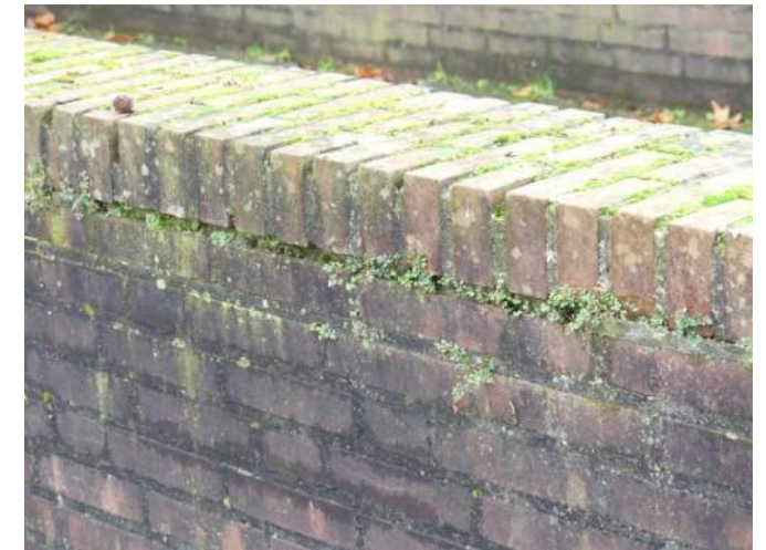
Afb. 04.22.34, alg- en mosgroei en uitgespoeld voegwerk onder rollaag
