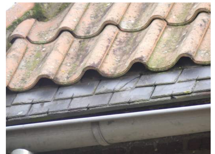
Afb. §33.10, beschadigde, scheefzakkende voetleien, foutieve leihaken (met klembek)
