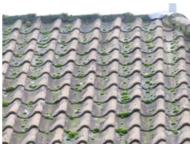
Afb. §33.16, detail achterste deel westzijde dak met veel mos en enkele kantelende dakpannen
