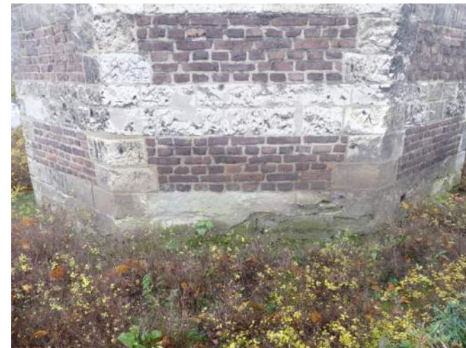
Afb. §15.01, overgroeide strook langs de gevels
