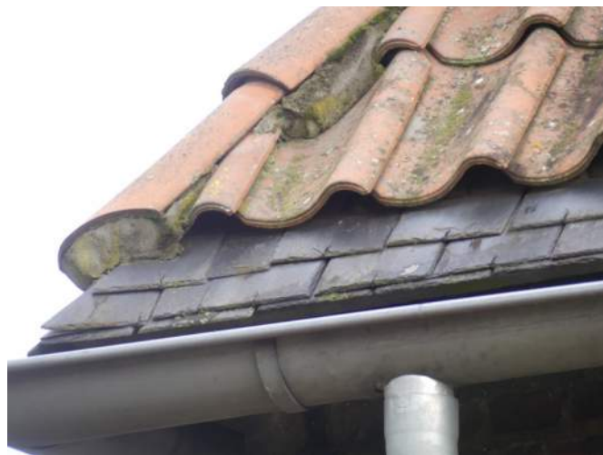
Afb. §33.11, verkeerde verdeling voetleien bij hoekkeper, uitzakkende en kantelende voetleien, losgescheurde schubvorsten
