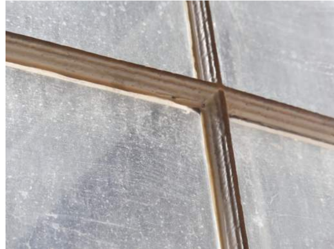
Afb. §34.02, detail vervuild en bekrast glas in smeedijzeren raamwerk
