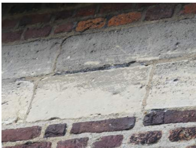
Afb. §22.03, mogelijk origineel voegwerk, in ieder geval afwijkend van het overige voegwerk, onder de dakoverstek
