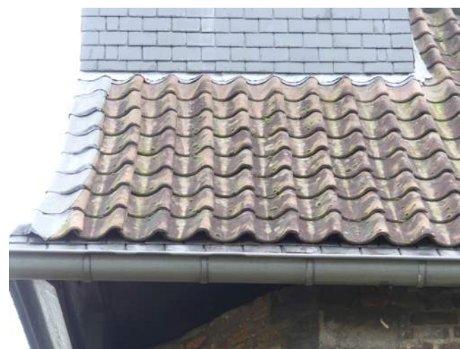
Afb. §33.19, detail voorste deel westzijde dak met slecht, slordig aangebracht kantlood (over de 'kant'-pannen) en voetlood (onder de leien tegen de dakruiter)
