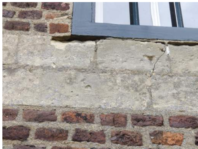
Afb. §35.05, gescheurd mergelblok en uitgevallen mortelreparatie
