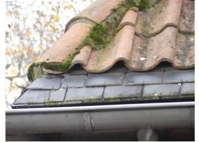
Afb. §33.06, verkeerde verdeling voetleien bij hoekkeper, foutieve leihaken (met klembek), slordig afgewerkte eindvorst
