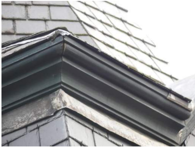
Afb. §33.23, detail zeer slecht loodwerk: o.a. ontbrekend voet-/druiplood onder de voetleien, onder eind keperlood ondeskundig gevouwen, onvoldoende overlap aan loodstroken onder houten profiellijst
