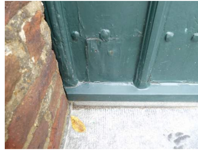
Afb. $46.09, afbladderend schilderwerk en slechte en/of verouderde reparatie
