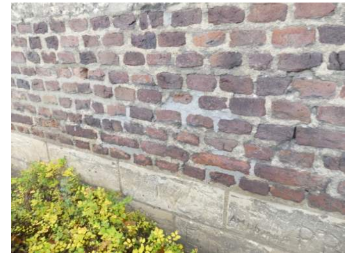
Afb. §22.10, slordig hersteld en uitgevallen voegwerk
