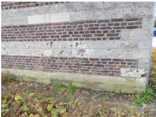
Afb. §22.01, beschadigde bakstenen, mogelijk kapotgevroren door te hard voegwerk
