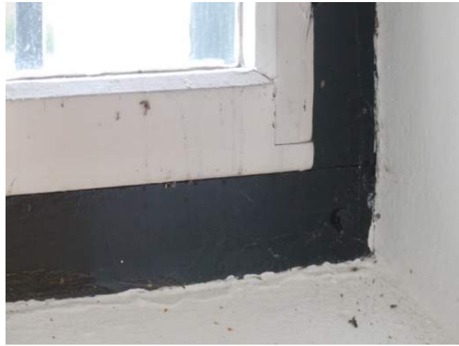
Afb. $46.04, onvoldoende dekkend schilderwerk
