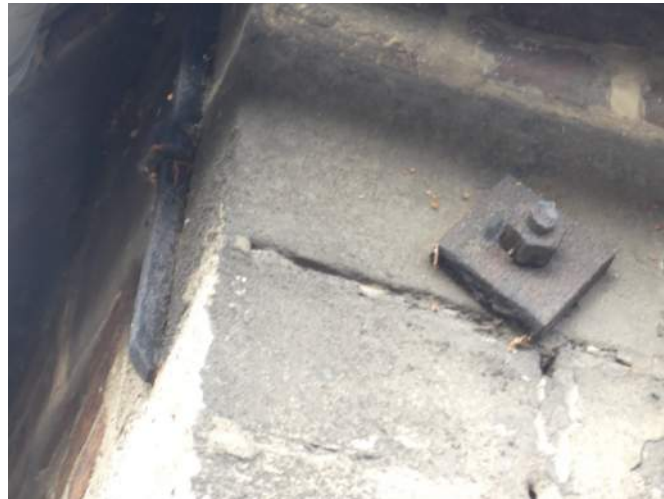
Afb. $46.06, roestvorming op ankerplaten en moeren
