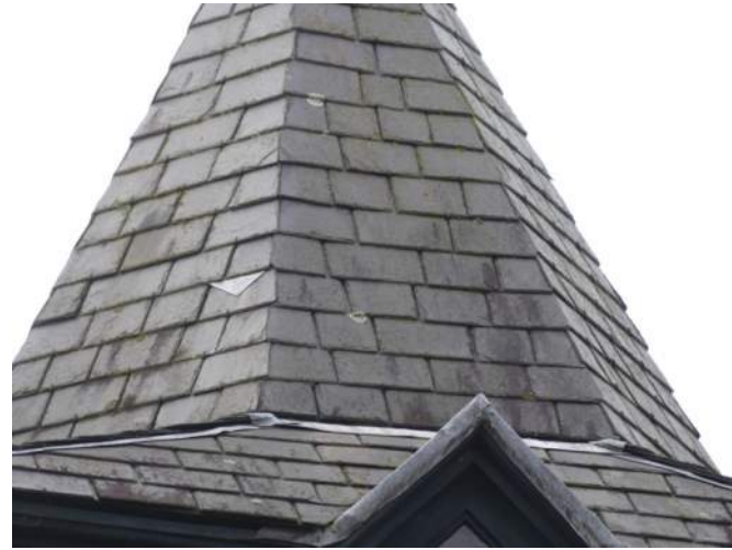
Afb. §33.24, slecht aangebracht torenleiwerk, o.a. te grote leien verwerkt, scheefgewaaide leien (mogelijk geen torendekking toegepast), uitzakkend keperlood
