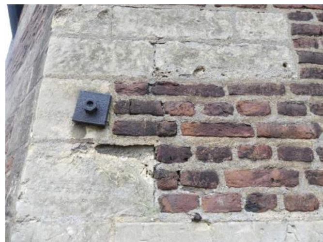
Afb. §35.08, beschadigde hoekblok en uitgevallen mortelreparaties
