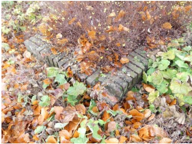
Afb. §15.05, uitgespoeld voegwerk uit tuinmuurtjes en verdwenen steen
