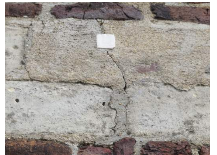
Afb. §35.02, slordig mortelherstel dat alweer gescheurd is (funderingsproblemen, verkeerstrillingen?)
