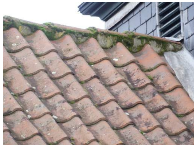
Afb. §33.03, met mos begroeide aangesmeerde nokvorsten, gapende opening onder slecht aangeklopt lood
