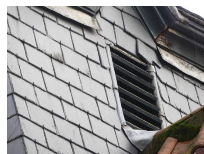
Afb. §33.22, slecht aangebracht leiwerk (bijv. pasleien < 0,5 lei verwerkt), te grote leien, uitzakkende leien, zeer slecht, tegen opwaaien onvoldoende geborgd loodwerk
