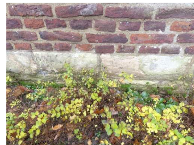
Afb. §35.14, beschadigde mergel blokken in plint zone
