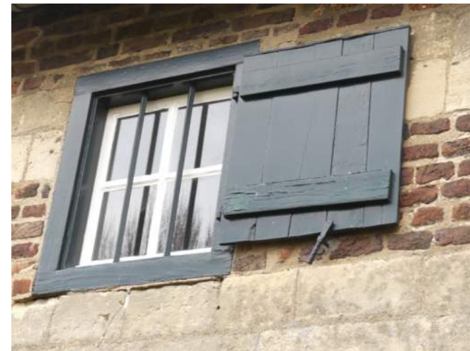
Afb. $46.11, ernstig gebarsten en loslatend schilderwerk van onderdorpel en liggende delen
