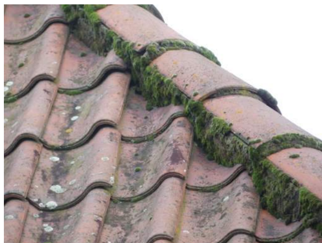
Afb. §33.13, sterk met mos begroeide aangesmeerde schubvorsten, uitgevallen stukjes mortel, losgescheurde schubvorsten, slecht liggende dakpannen naast de hoekkeper
