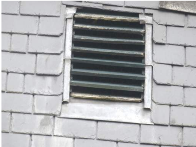
Afb. §30.01, overzicht ventilatielamellen in dakruiter
