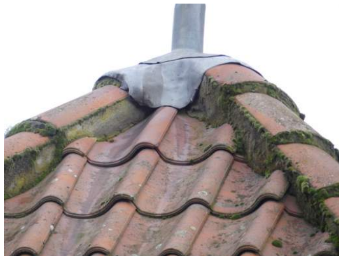
Afb. §33.12, openingen onder slecht aangebracht loodwerk, sterk met mos begroeide aangesmeerde schubvorsten
