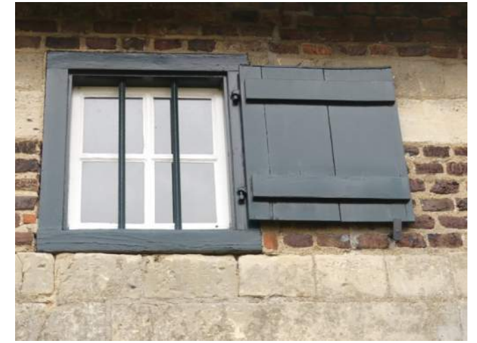
Afb. $46.10, gebarsten, loslatend schilderwerk op -met name- onderdorpel en liggende delen
