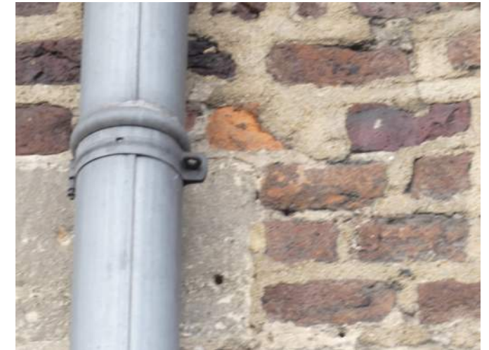
Afb. §22.08, slordig hersteld voegwerk en beschadigde steen
