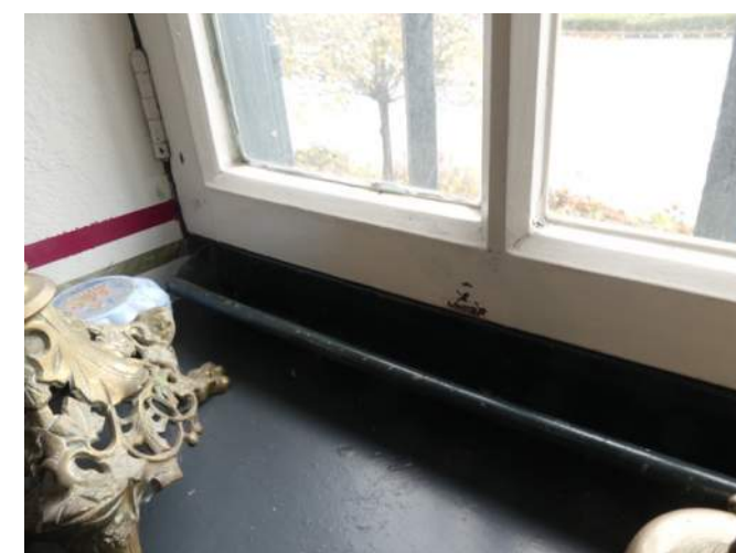
Afb. §46.02, slordig, onvoldoende opgezet schilderwerk
