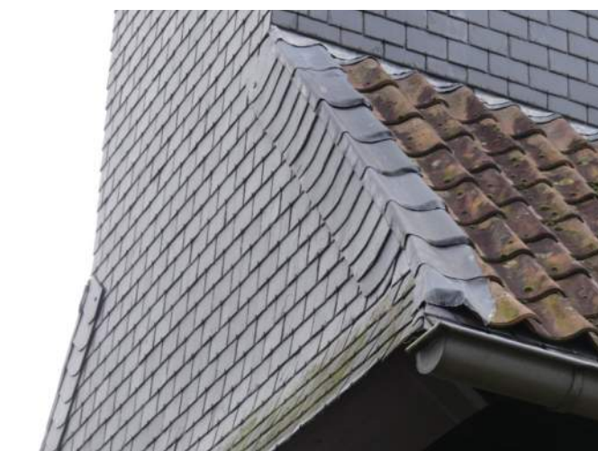
Afb. §33.20, vele te grote koeverleien, bovenste koeverlei niet ingedekt met lood, zeer slordig aangebracht, gapend kantlood
