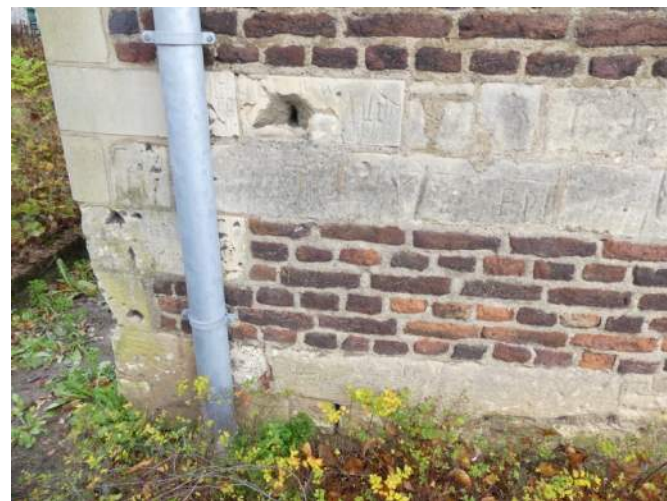
Afb. §35.06, beschadigde (hoek-)blokken en uitgevallen mortelreparaties
