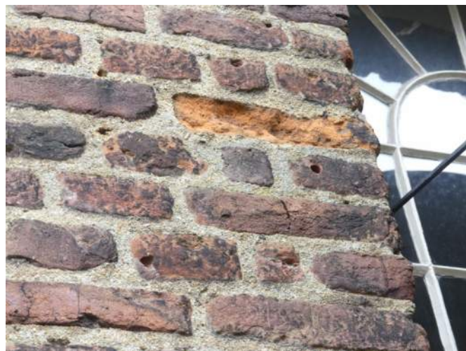
Afb. §22.02, beschadigde baksteen, mogelijk kapotgevroren door te hard voegwerk
