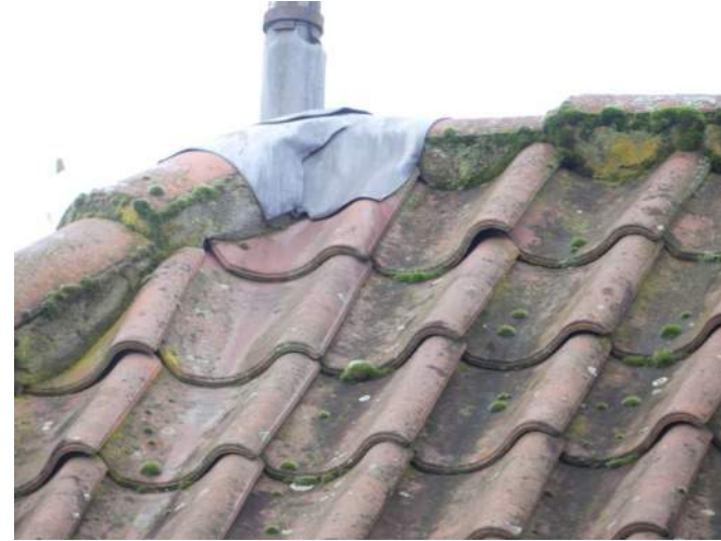
Afb. §33.05, kantelende en gapende dakpannen bij hoekkeper en sterke mos begroeiing op aansmeerwerk, opening onder slecht aangebracht loodwerk
