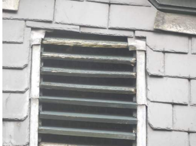
Afb. §30.02, detail aangetaste ventilatielamellen
