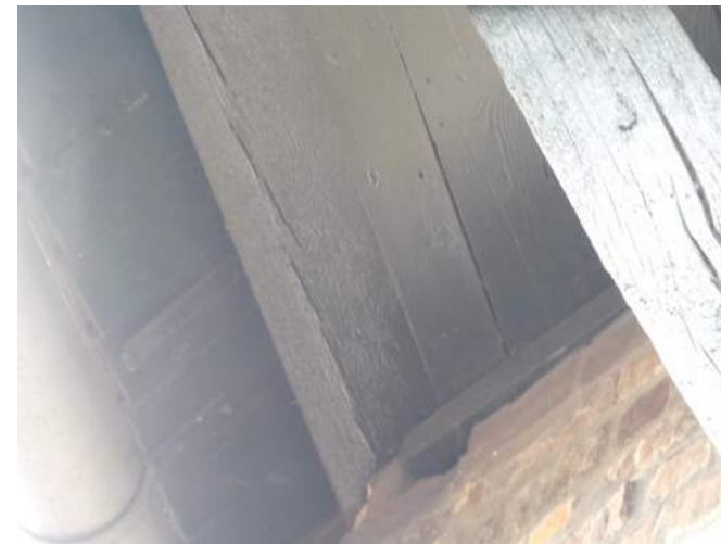
Afb. §24.11, overzicht dakbeschot onder overstek, schraal schilderwerk
