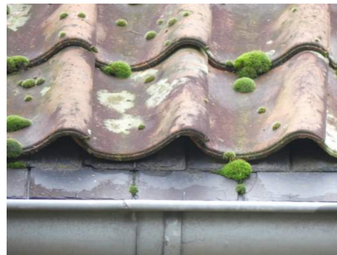
Afb. §33.17, foutieve leihaken (met klembek) op voetleien en versleten, beschadigde voetleien
