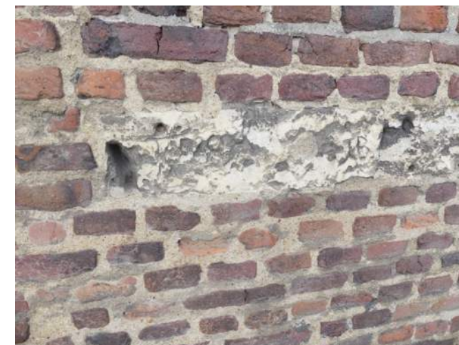
Afb. §35.12, boorgangen in mergelblokken
