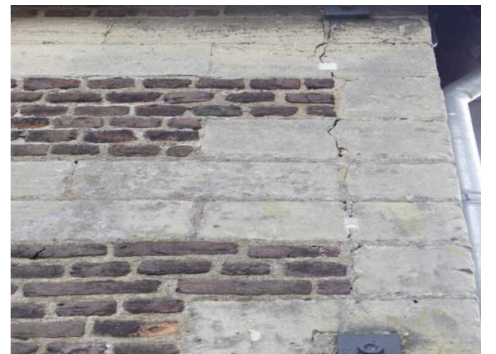
Afb. §35.04, aftekening verticale scheur door mergelblokken en langs aansluiting hoekblokken met baksteen lagen
