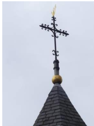
Afb. §70.02, ontbreken bliksemafleiderinstallatie
