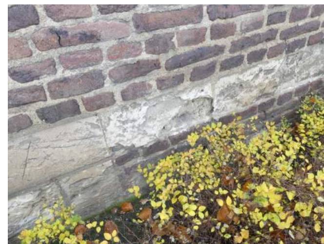
Afb. §35.13, afschilferende mergel blok (staand verwerkt?)
