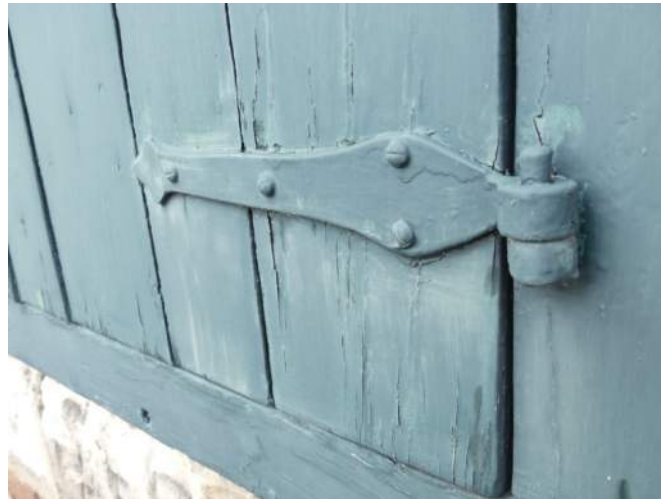
Afb. §46.18, slordig uitgevoerd schilderwerk op gehengen (druipsproen), slecht dekkend en gebarsten schilderwerk op houten delen
