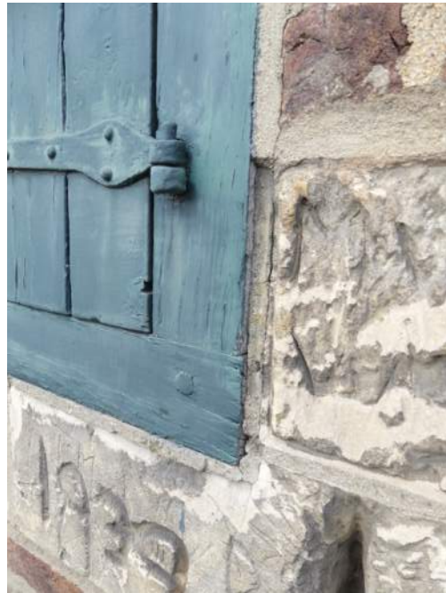
Afb. §46.16, gebarsten schilderwerk op kozijn en luik, slechte dekking toplaag
