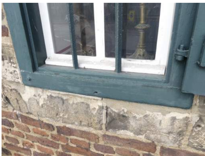
Afb. §46.19, schraal, gebarsten schilderwerk op liggende delen van kozijn en raam en verbindingen
