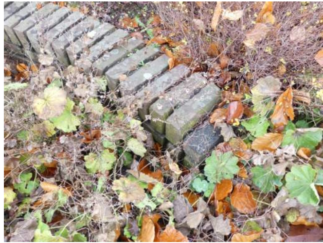
Afb. §15.06 uitgespoeld voegwerk uit tuinmuurtjes en losse oneigenlijke steen
