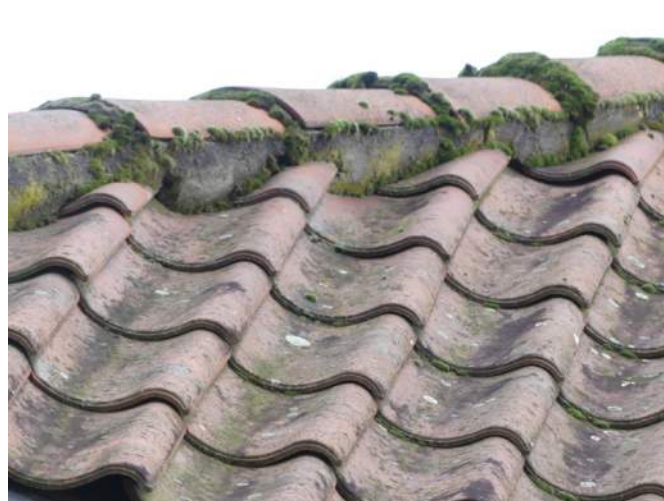
Afb. §33.14, sterk met mos begroeide aangesmeerde schubvorsten, uitgevallen stukjes mortel, losgescheurde schubvorsten en kantelende dakpannen bij hoekkepers
