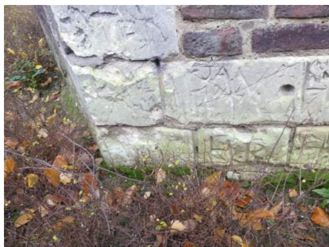
Afb. §35.07, uitgevallen mortelreparaties
