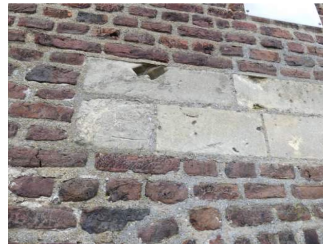
Afb. §35.11, te hard voegwerk en uitgevallen stukken mergel en mortelreparaties
