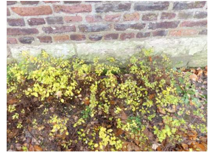
Afb. §22.06, uitgespoeld voegwerk bij maaiveld
