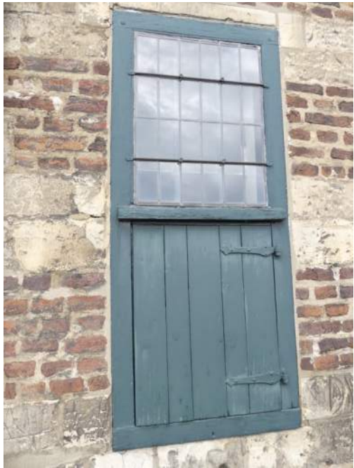
Afb. §46.15, gebarsten en loslatend schilderwerk op liggende delen van kozijn, vaal schilderwerk op luik
