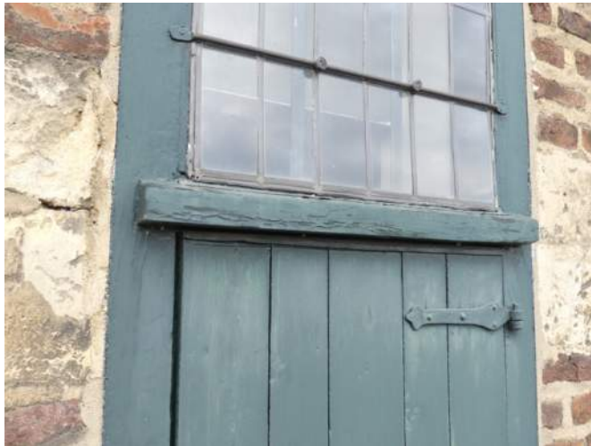
Afb. §46.17, ernstig gebarsten en loslatend schilderwerk van liggende delen en verbindingen, slecht dekkende toplaag op luik
