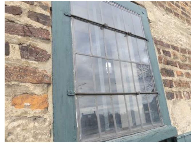
Afb. §34.05, defecte en ontbrekende veter op bindroede
