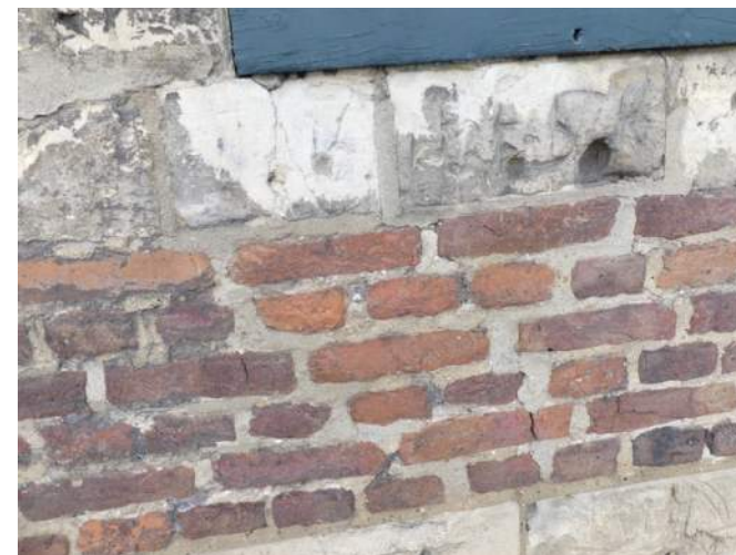
Afb. §22.09, slordig hersteld voegwerk
