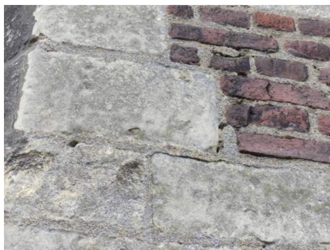
Afb. §22.04, beschadigd, te hard (cementhoudend) voegwerk
