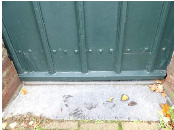
Afb. $46.08, onderzijde toegangsdeur
