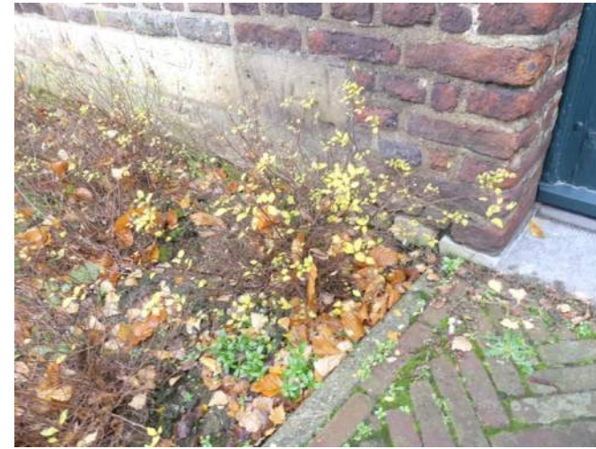
Afb. §22.05, uitgespoeld voegwerk bij maaiveld
