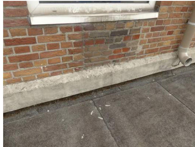
Afb. 5.3.28, slordig herstelde sparing en vervuilde gevel (door ontbreken overstek raamdorpel), gevel 18
