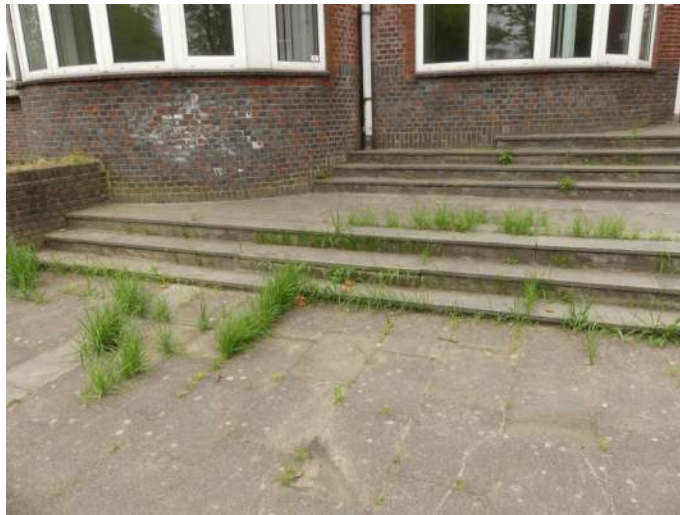
Afb. 5.0.01, verzakt tegelwerk bordes 01
