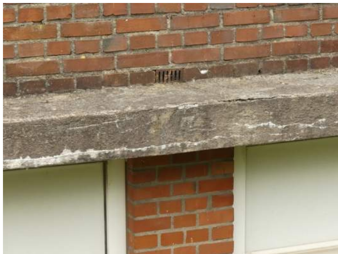
Afb. 5.2.07, losliggende smeerlaag, scheuren in latei en uitbloei
