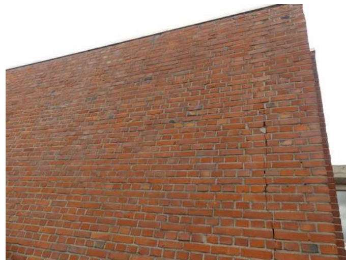
Afb. 5.3.32, gescheurd metselwerk, gevel 8
