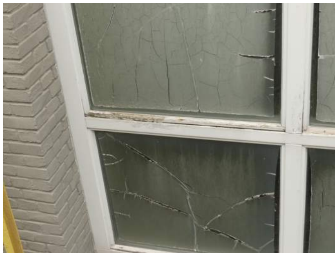
Afb. 5.10.09, versleten verfwerk, gevel 24
