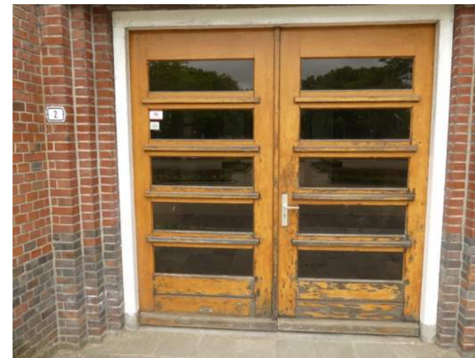
Afb. 5.4.01, uitgewaterde wellatten en moderne, detonerende handgreep, gevel 01
