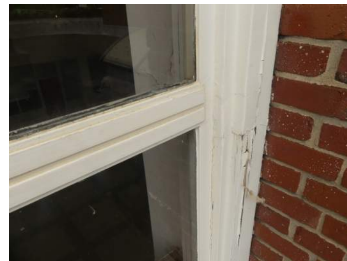
Afb. 5.4.05, slecht gedetailleerd herstelstuk zijstijl, gevel 06
