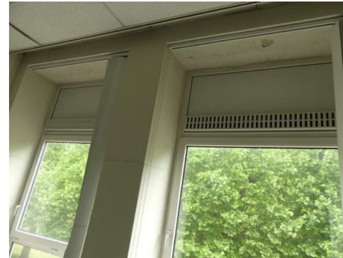
Afb. 5.12.31, lekkagesporen boven kozijnen
