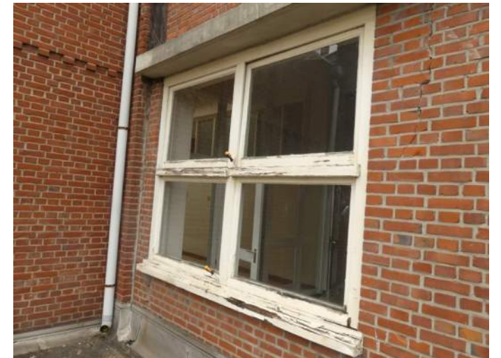
Afb. 5.10.04, volledig versleten verfwerk, gevel 08
