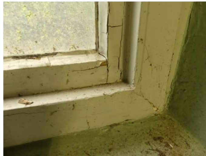
Afb. 5.4.20, openstaande verbindingen, scheur in raamdorpel, gevel 09-16
