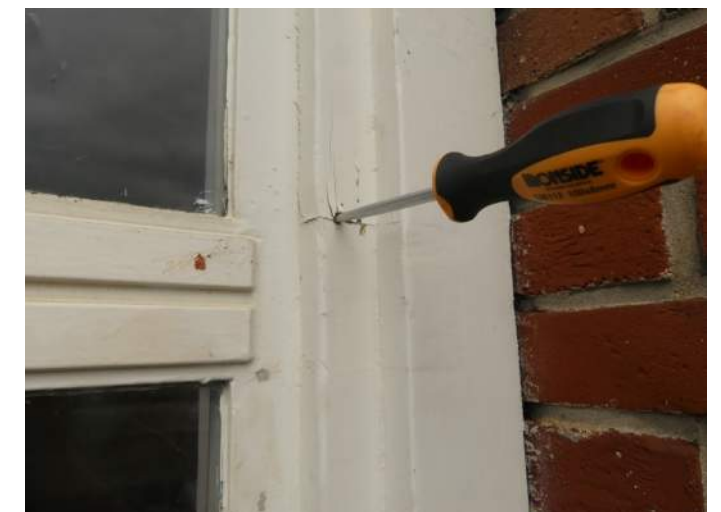
Afb. 5.4.06, detail slechte herstelling, gevel 06
