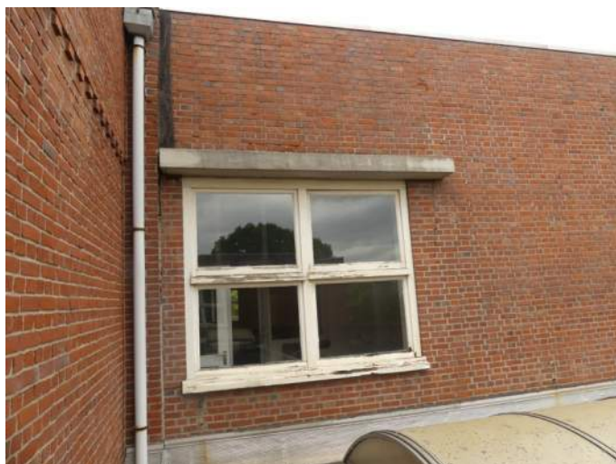
Afb. 5.3.31, gescheurd -en deels provisorisch dichtgezet- dilatatie en metselwerk rond venster, gevel 8
