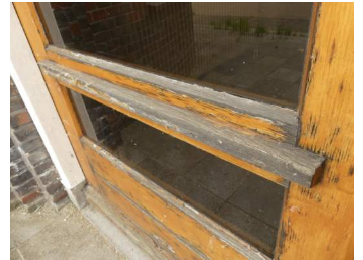
Afb. 5.10.02, verspreid volledige verdwenen afwerklaag hoofdentree, gevel 01
