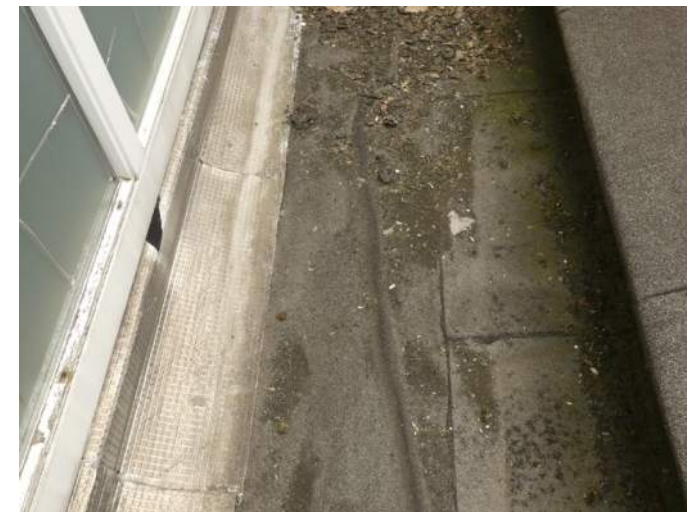
Afb. 5.6.24, geplooide dakbedekking en slechte aansluiting, dak 07
