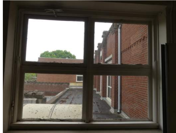
Afb. 5.12.26, raamkozijn (gevel 08), ontbrekende elementen
