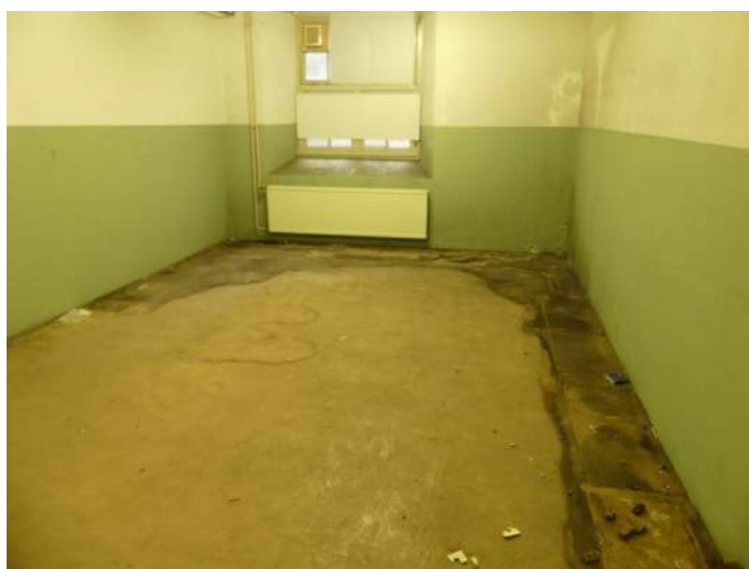
Afb. 5.12.03, lekkage- of wateroverlastsporen
