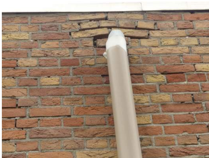
Afb. 5.3.27, ontzet metselwerk, gevel 18
