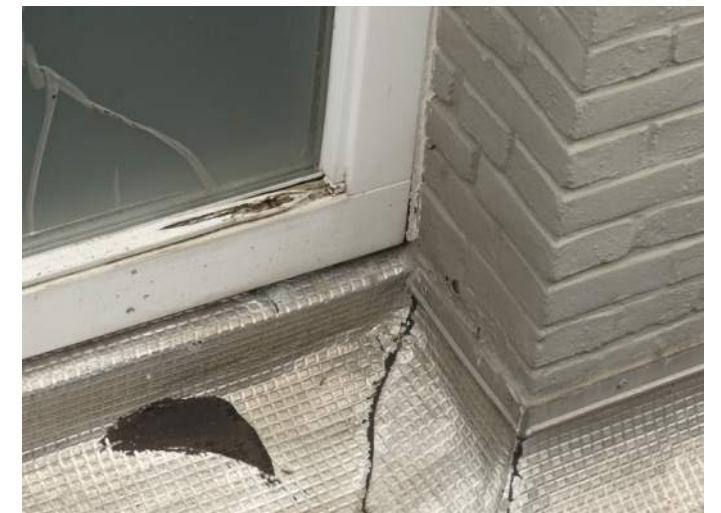
Afb. 5.4.28, verrotte glaslat, gevel 24
