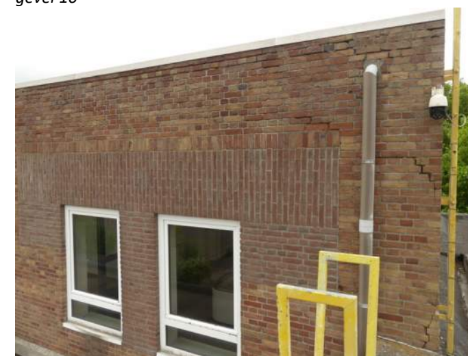
Afb. 5.3.26, gescheurd metselwerk en uitgevallen voegwerk, gevel 18
