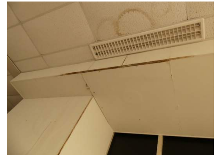
Afb. 5.12.46, lekkageschade op systeemplafond en koofbetimmering
