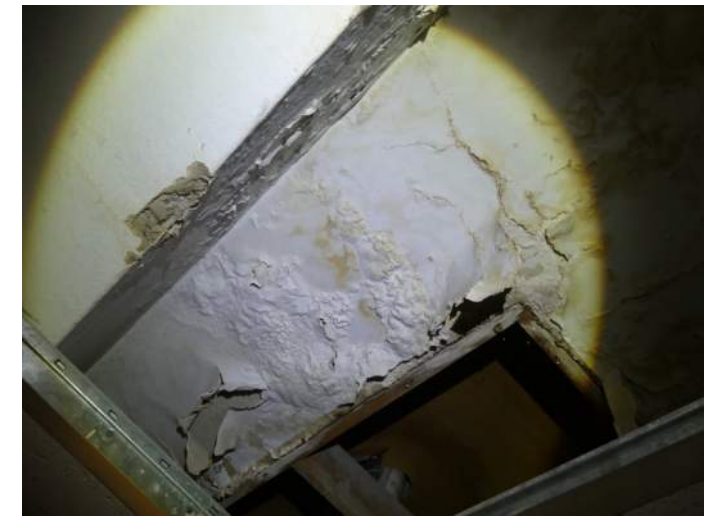
Afb. 5.12.44, vocht- en zoutuittreding door lekkage
