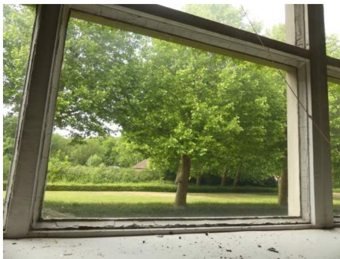
Afb. 5.7.03, uitgedroogde stopverfzomen beglazing, begane grond
