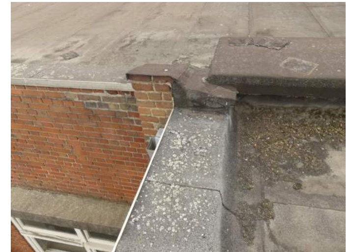
Afb. 5.6.10, slechte aansluiting en reparaties, dak 05
