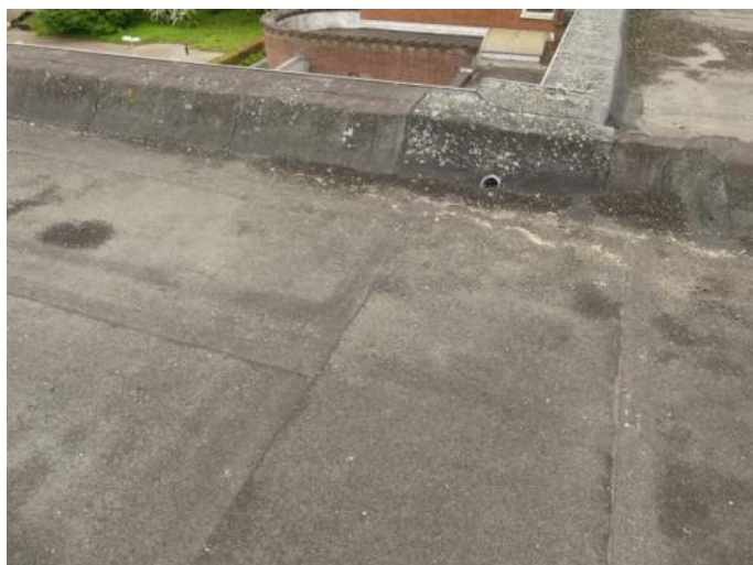
Afb. 5.6.29, blaasvorming en verzameld vuil bij doorvoer, dak 10
