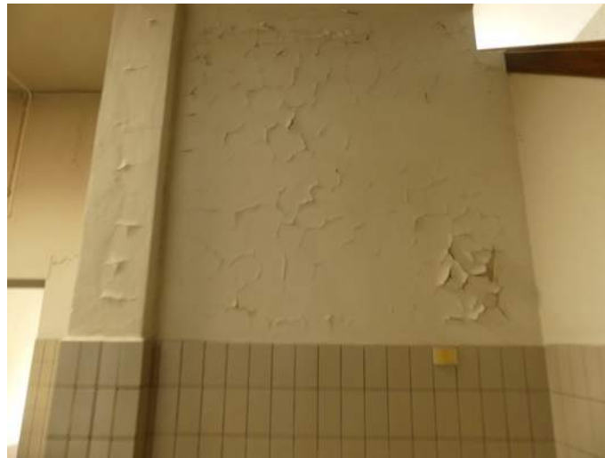
Afb. 5.12.14, afbladderende verf van wanden zijruimtes Loonhal
