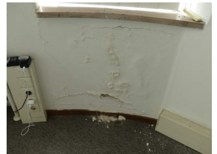
Afb. 5.12.24, afgedrukt, vochtbelast pleisterwerk in ruimtes naast hoofdentree
