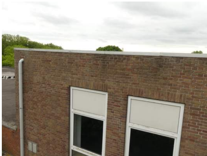
Afb. 5.3.15, loszittend voegwerk en gescheurd metselwerk, gevel 11
