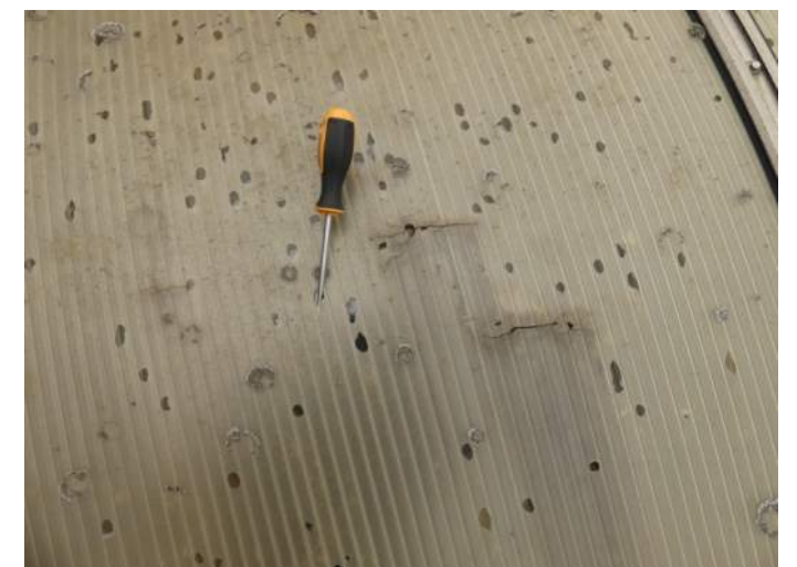
Afb. 5.4.30, gaatjes in uitgeharde kunststof daklicht, dak 04
