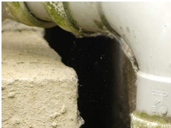
Afb. 5.3.19, openstaande dilatatie, gevel 11
