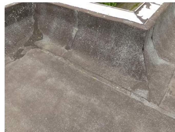
Afb. 5.6.35, foutief aangebrachte, begroeide mastiek, dak 13
