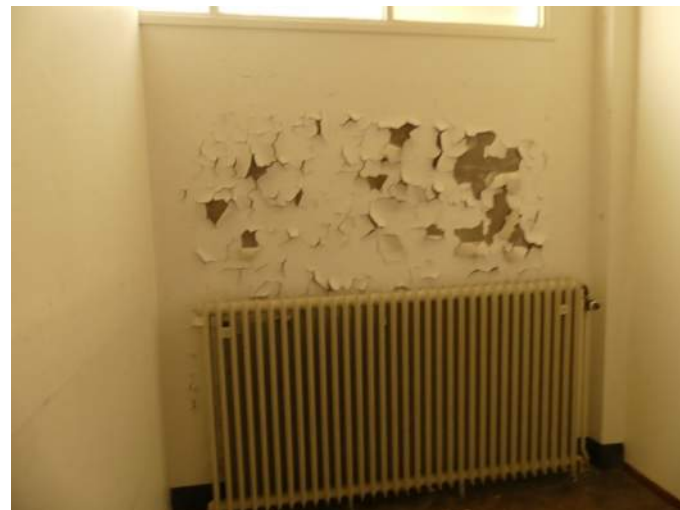
Afb. 5.12.30, afbladderende verf boven radiator, binnenmuur
