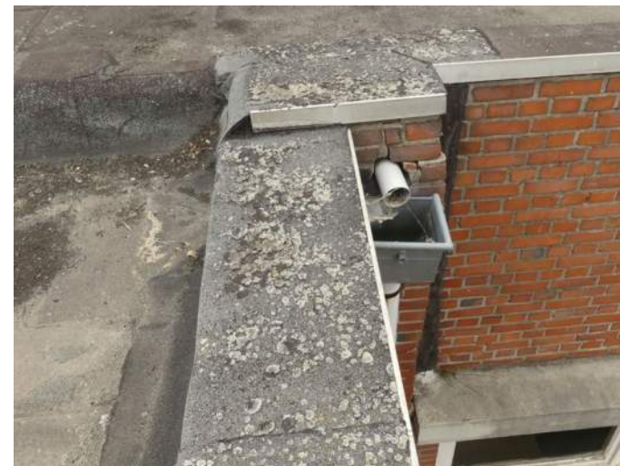
Afb. 5.6.21, slechte detaillering en PVC geveldoorvoer, dak 06
