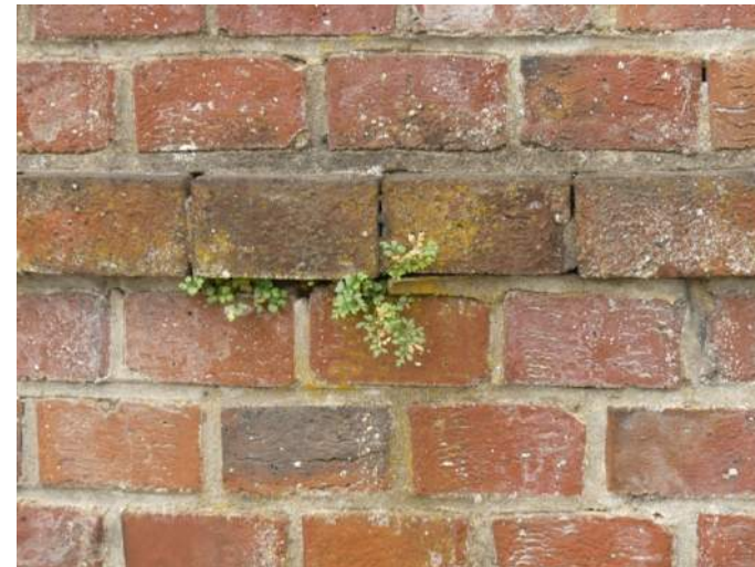
Afb. 5.3.11, loszittend, uitgevallen te hard voegwerk gevel 02
