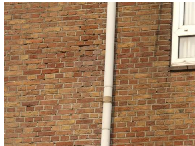
Afb. 5.3.13, loszittend, uitgevallen voegwerk gevel 12
