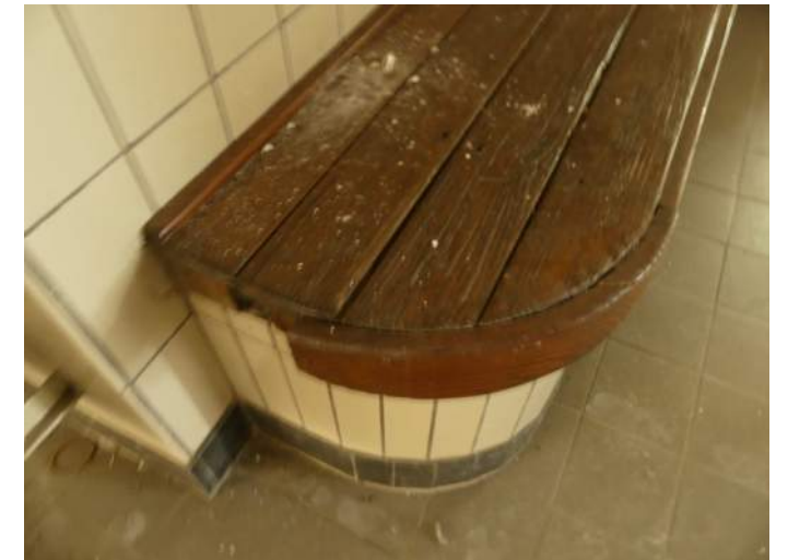
Afb. 5.12.22, beschadigde 'wacht-banken' in en rond feitelijke voormalige Loonhal
