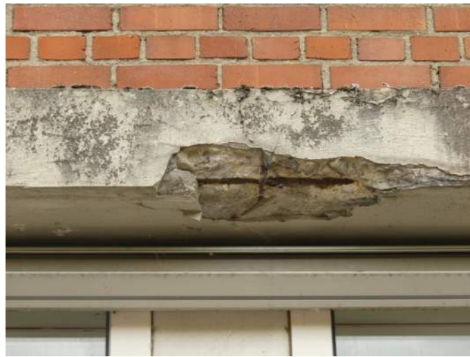
Afb. 5.2.04, door roestende wapening afgebroken dekking
