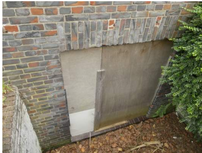
Afb. 5.4.34, dichtgezet (vermoedelijk) kunststof kozijn in koekoek, gevel 11
