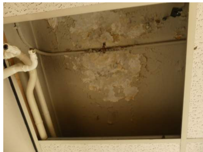
Afb. 5.12.42, lekkageschade achter systeemplafond
