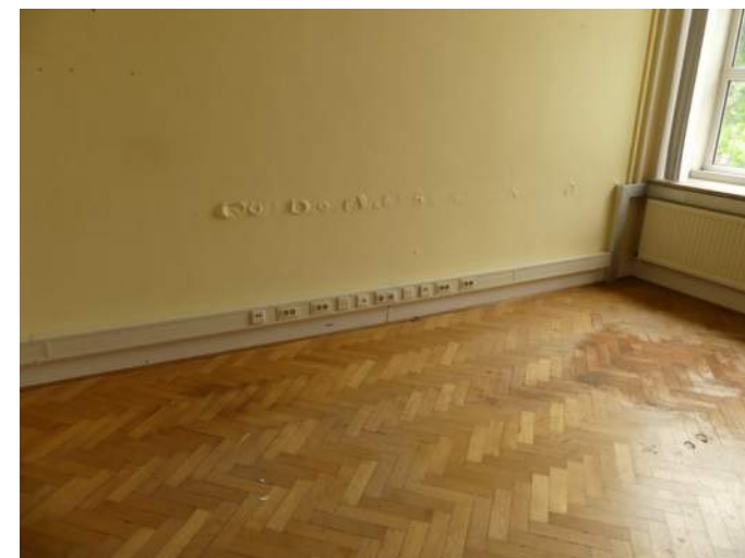
Afb. 5.12.35, beschadigde parketvloer en wand
