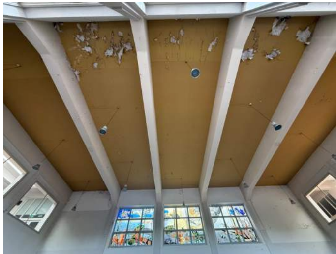
Afb. 5.12.13, afbladderende verf van plafond feitelijke voormalige Loonhal
