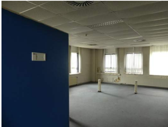
Afb. 5.12.49, overzicht kantoorvertrek met schades, plafond en wanden
