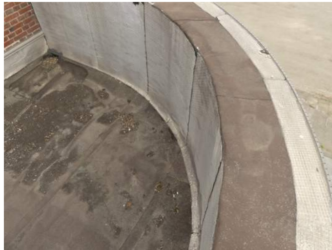
Afb. 5.6.04, versleten aansluitingen en blaasvorming, dak 03
