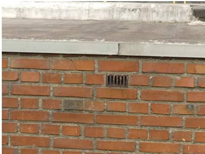
Afb. 5.9.03, verroest ventilatierooster onder dakrand, gevel 11
