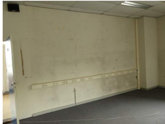
Afb. 5.12.50, aftekening vochtschade op binnenwand
