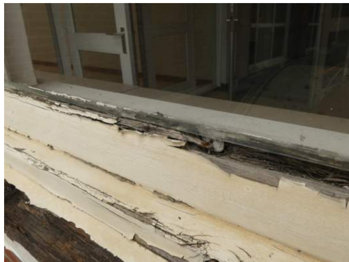
Afb. 5.4.12, verrotte onderdorpel, gevel 08
