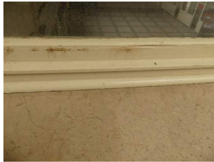
Afb. 5.12.38, roestvorming op stalen binnenkozijnen
