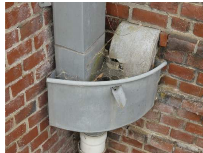
Afb. 5.11.01, versleten zink, te volle (of te kleine) vergaarbak met PVC hwa, gevel 04
