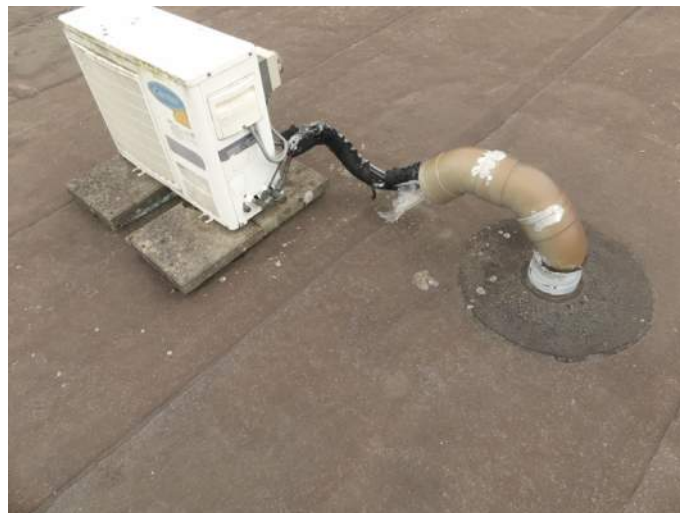
Afb. 5.6.16, versleten dakdoorvoer airco, dak 05
