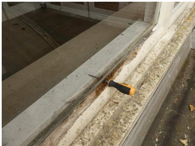
Afb. 5.4.09, verrotte onderdorpel, gevel 07
