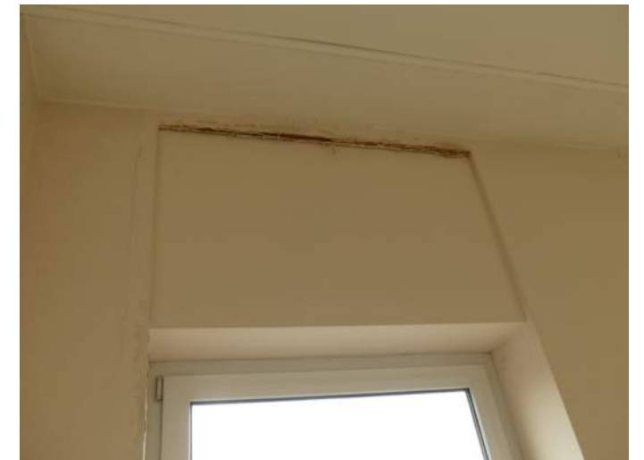
Afb. 5.12.56, roestsporen bij aansluiting koof-plafond
