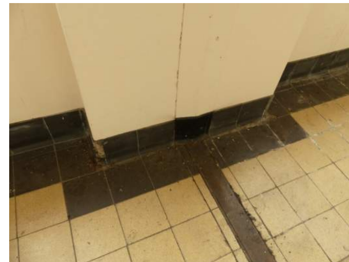
Afb. 5.12.59, beschadigde hoek tegelplint
