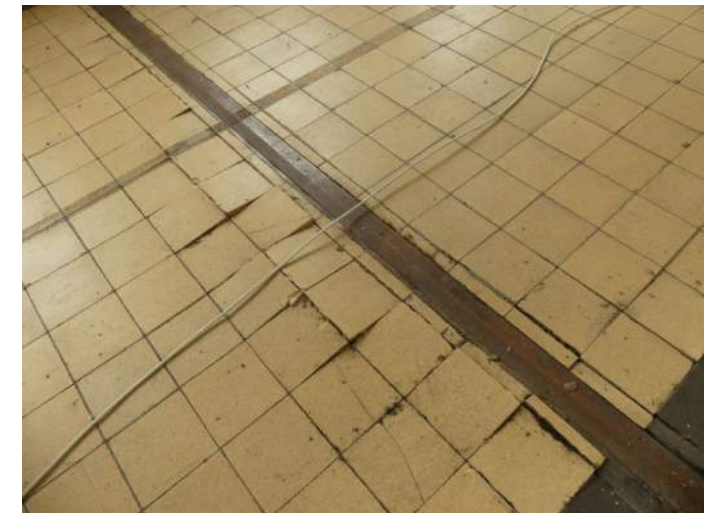
Afb. 5.12.58, opgeduwde tegels bij dilatatie door werking gebouw
