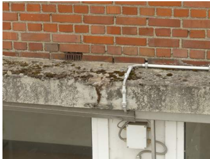
Afb. 5.9.02, verroest ventilatierooster boven betonlatei, gevel 10
