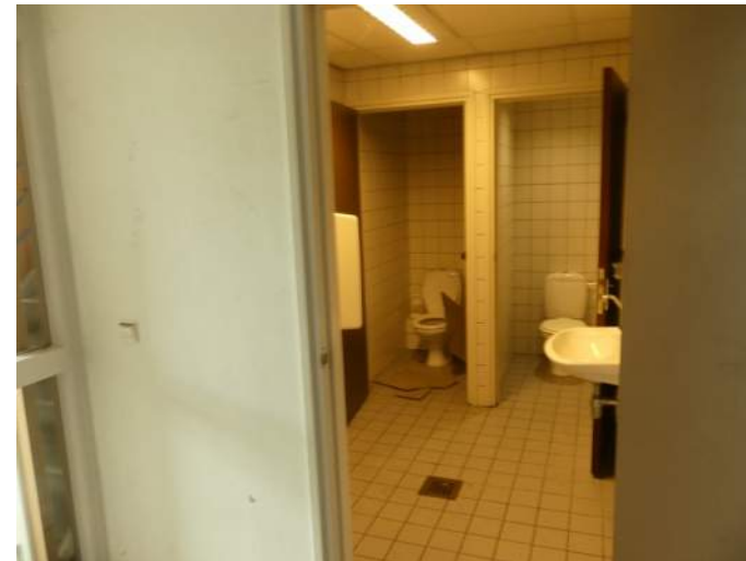
Afb. 5.12.21, vervallen plafond in sanitaire ruimtes
