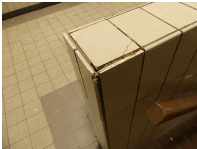
Afb. 5.12.01, beschadigd tegelwerk bij keldertrap
