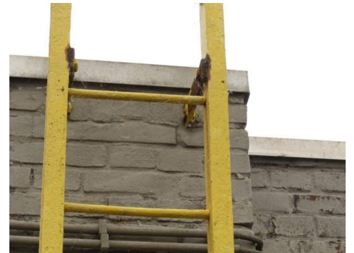
Afb. 5.5.04, roestvorming op bevestigingssteunen, gevel 24,
