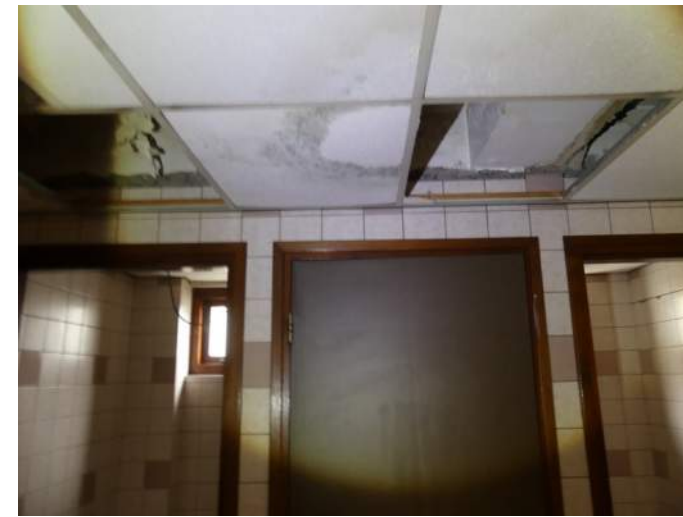
Afb. 5.12.43, volledig, door lekkage, vervallen plafond sanitaire ruimte
