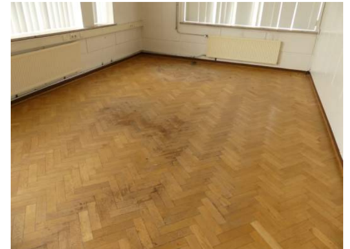
Afb. 5.12.34, gevolgschade van lekkage aan onderliggende parketvloer
