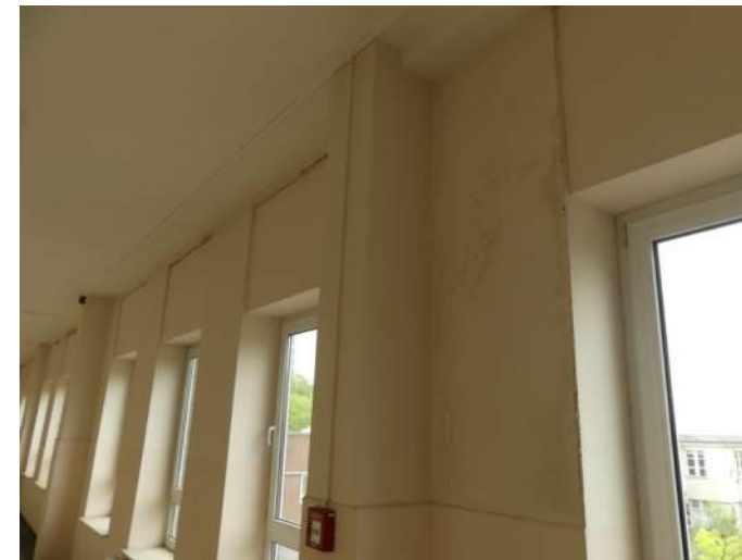
Afb. 5.12.55, koven boven de (kunststof kozijnen), constructie onbekend, maar vermoedelijk met stalen constructie
