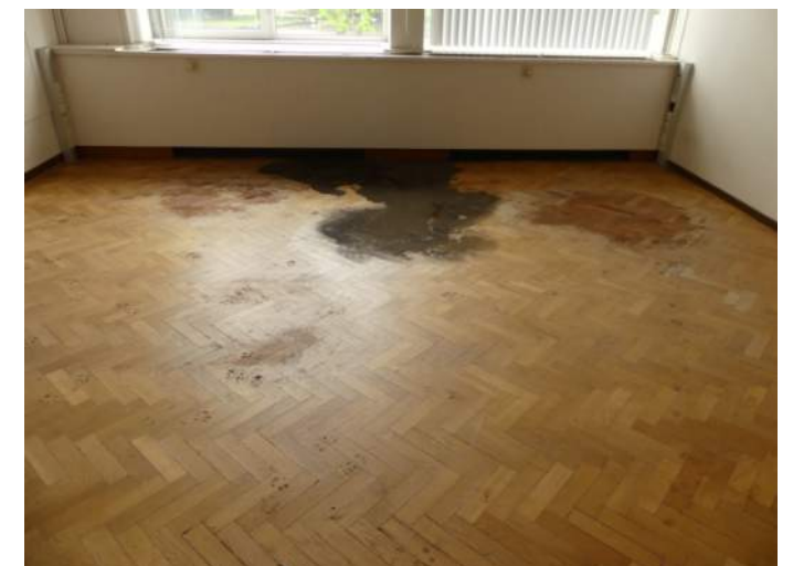
Afb. 5.12.36, door lekkage veroorzaakte beschadiging en vervuiling parketvloer
