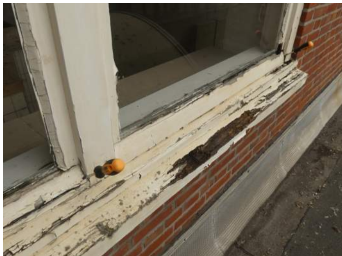
Afb. 5.4.11, verrotte onderdorpel, gevel 08
