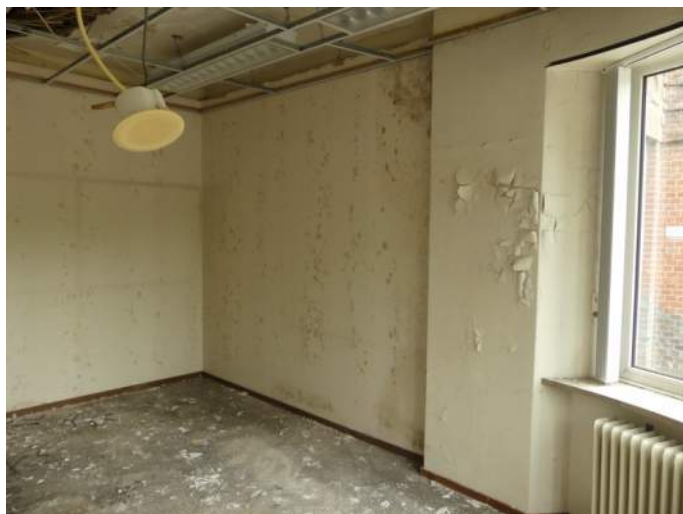
Afb. 5.12.17, vochtlekages, en gevolgschade, in ruimtes naast hoofdentree
