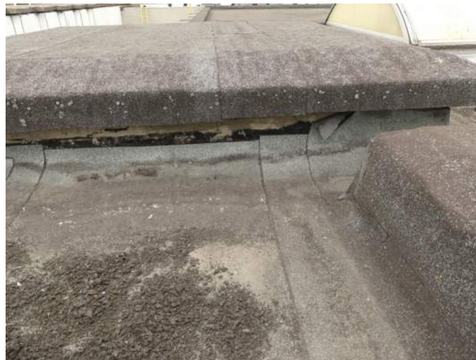
Afb. 5.6.14, slechte uitvoering reparatie, dak 05
