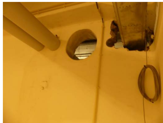
Afb. 5.12.09, slordig aangebrachte en vervallen sparingen
