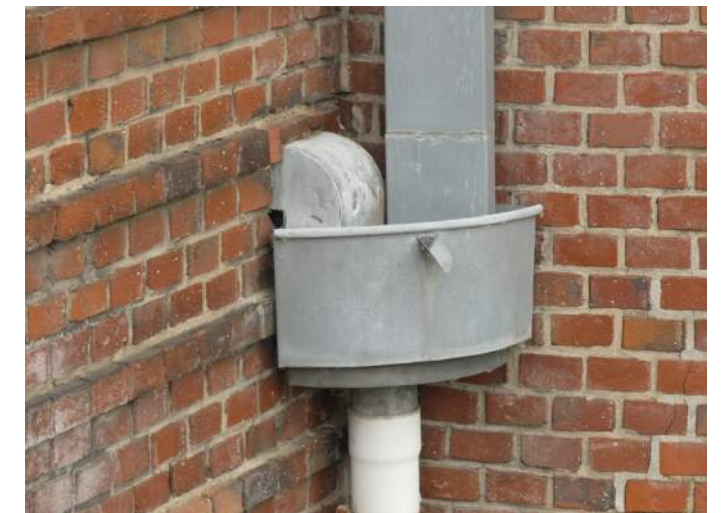
Afb. 5.11.02, versleten zink, te volle (of te kleine) vergaarbak met PVC hwa, gevel 05
