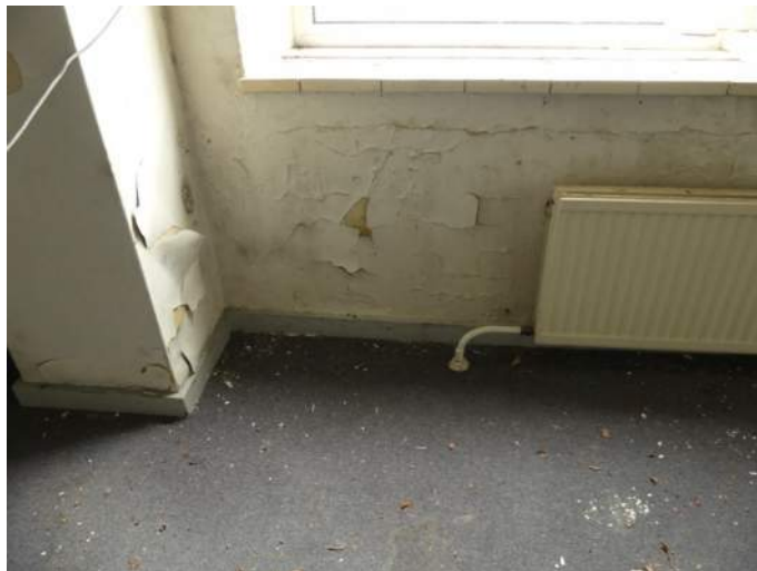
Afb. 5.12.51, afbladderende verf, roest op radiator(leiding)
