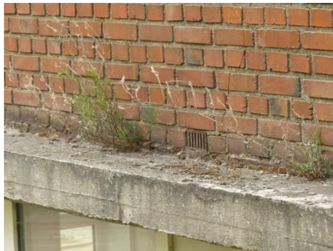
Afb. 5.9.06, verroest ventilatierooster boven betonlatei, gevel 11
