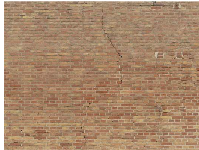
Afb. 5.3.21, gescheurd metselwerk en uitgevallen voegwerk, gevel 12
