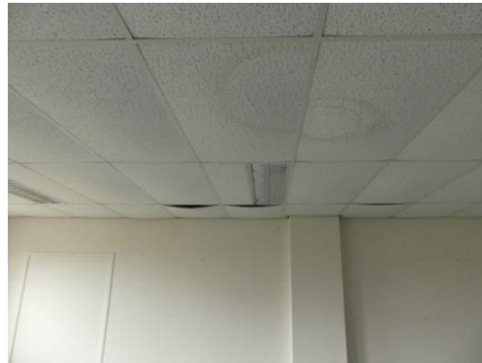
Afb. 5.12.28, uitgezette systeemplafondoplaten met lekkagesporen
