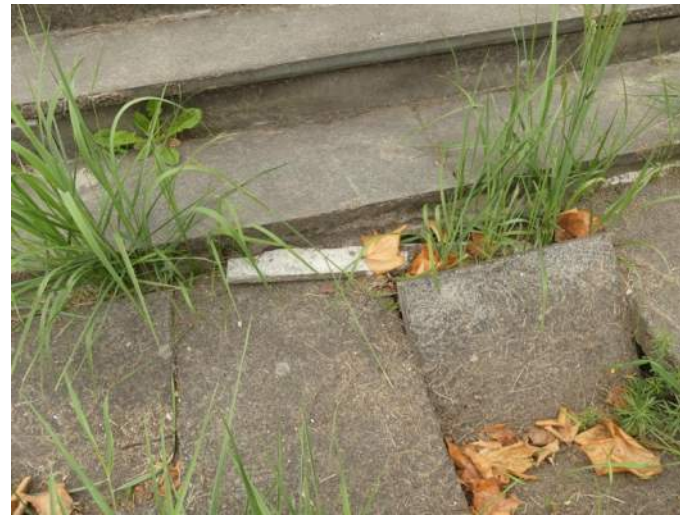
Afb. 5.0.02, verzakt tegelwerk bordes 01
