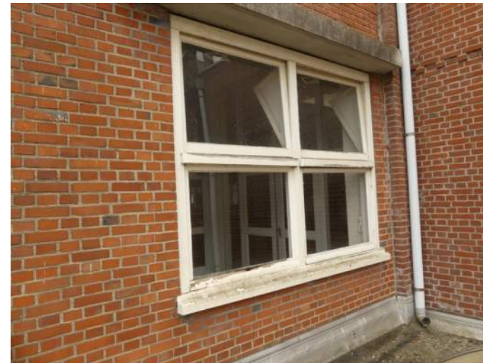
Afb. 5.10.03, versleten verfwerk, gevel 07
