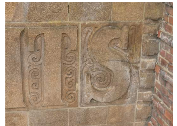
Afb. 5.3.02, vervuiling en gescheurde elementen
