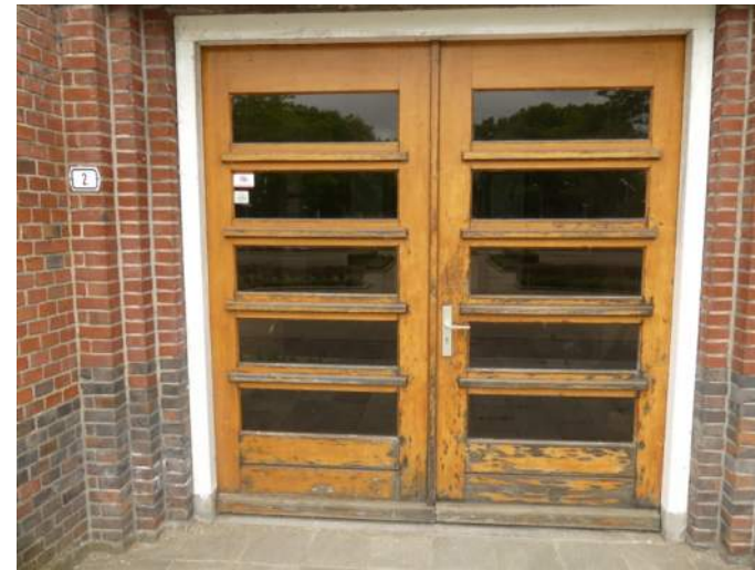
Afb. 5.10.01, afbladderende transparante verf hoofdentree, gevel 01
