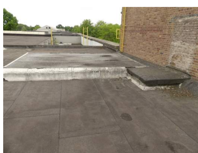
Afb. 5.6.28, ontbrekend muurlood gevel 20, dak 10
