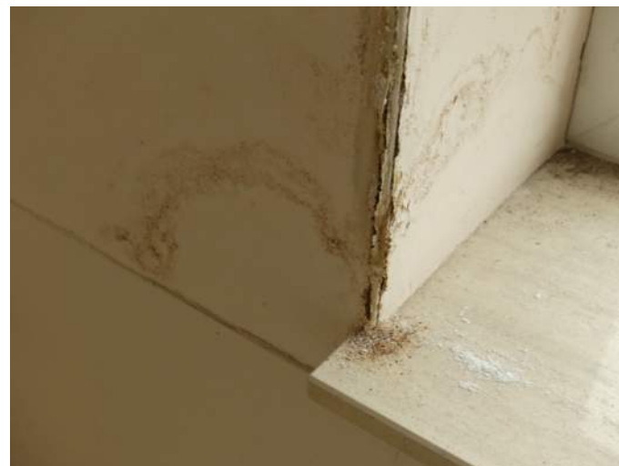
Afb. 5.12.54, lekkageschade aan binnenzijde gevel, roestend hoekprofiel stucwerk
