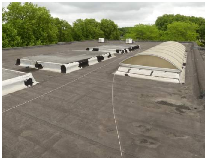
Afb. 5.6.27, overzicht dak 10 met stukgewaaide aansluitingen
