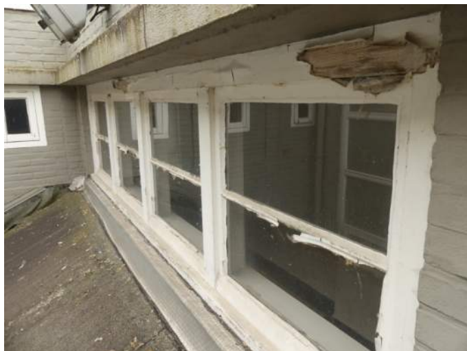
Afb. 5.10.11, afbladderende verf, gevel 26
