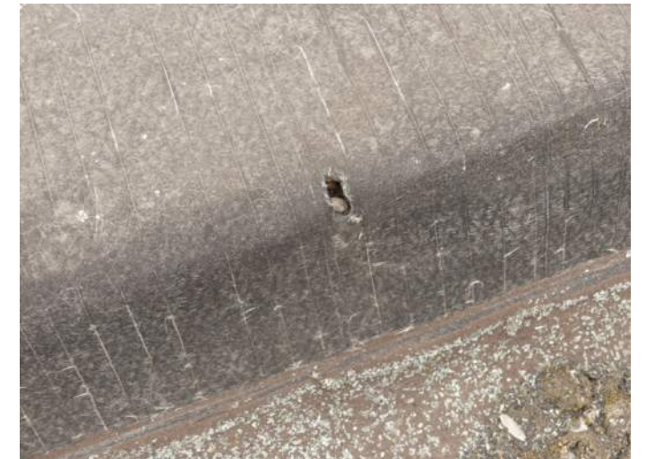
Afb. 5.6.12, versleten dakbedekking met gaatje, dak 05
