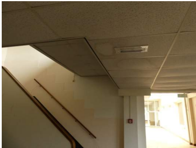
Afb. 5.12.27, uitgezette systeemplafondplaten, lekkage?
