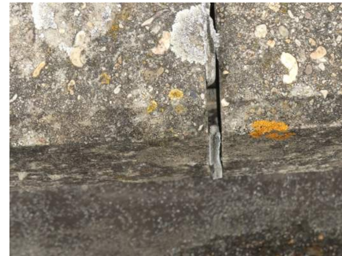
Afb. 5.6.20, verdwenen kitvoegen, afdek gevel 14, dak 14
