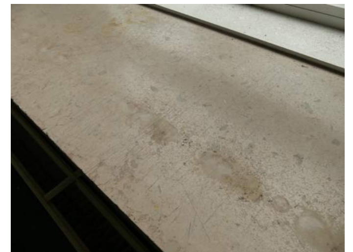
Afb. 5.12.48, mechanisch beschadigde natuursteen vensterbanken
