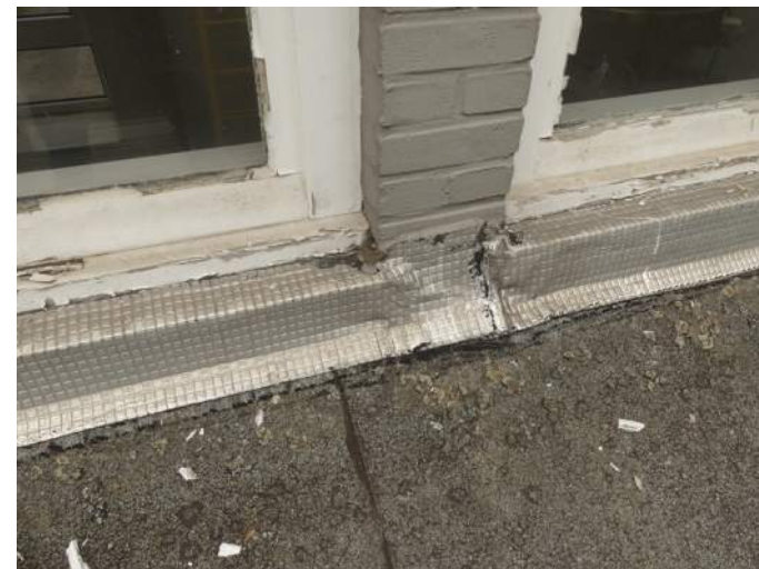
Afb. 5.6.23, ontbreken van loodslabbe onder kozijn, dak 08
