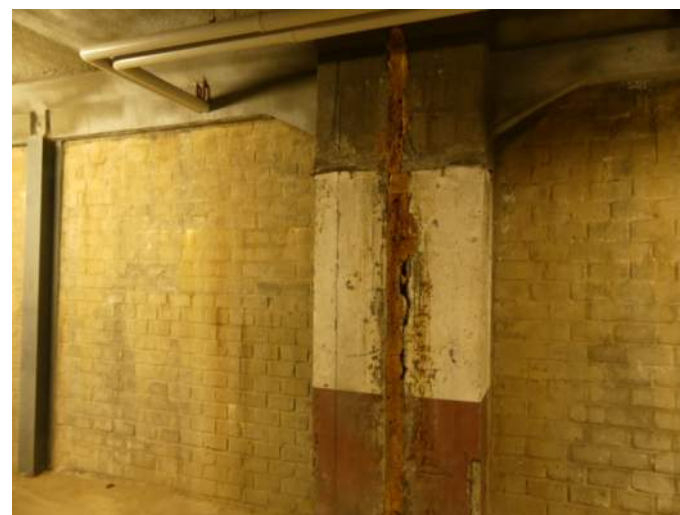
Afb. 5.12.11, onregelmatige dilatatienaad in grote kelder
