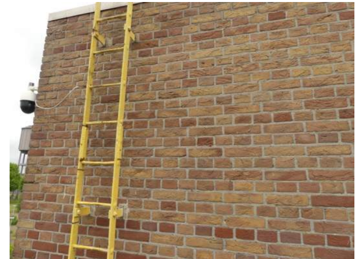
Afb. 5.5.02, dakladder voldoet niet aan veiligheids- dan wel arbo voorschriften, gevel 20
