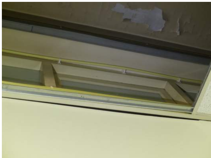
Afb. 5.12.29, afbladderende verf van origineel plafond en slordig leidingverloop
