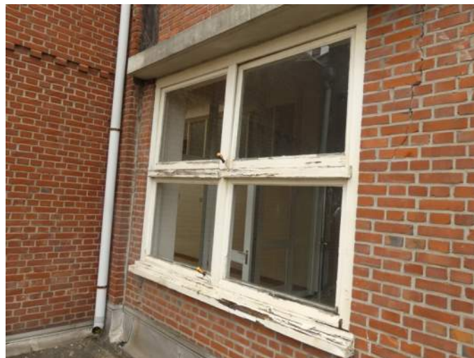
Afb. 5.4.10, uitgewaterde tussen- en onderdorpel, gevel 08
