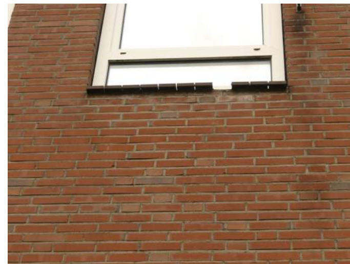
Afb. 5.3.23, afgebroken raamdorpelsteen, gevel 14
