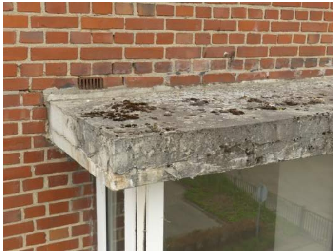
Afb. 5.9.01, verroest ventilatierooster boven betonlatei, gevel 10
