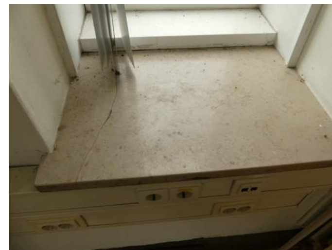
Afb. 5.12.47, gebroken natuursteen vensterbanken
