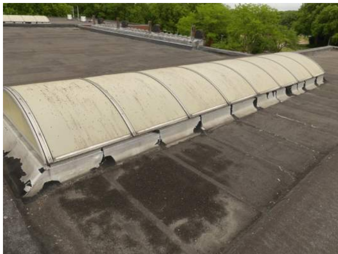
Afb. 5.6.15, slechte aansluiting en (vermoedelijk) verkeerd afschot, dak 05
