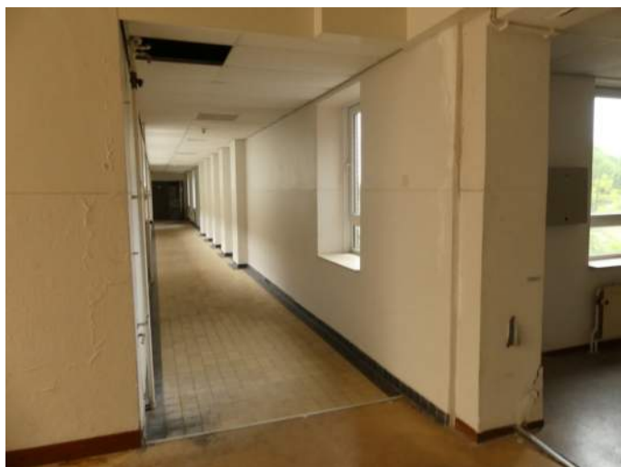
Afb. 5.12.41, overzicht gang aan achterzijde Loonhal met schades
