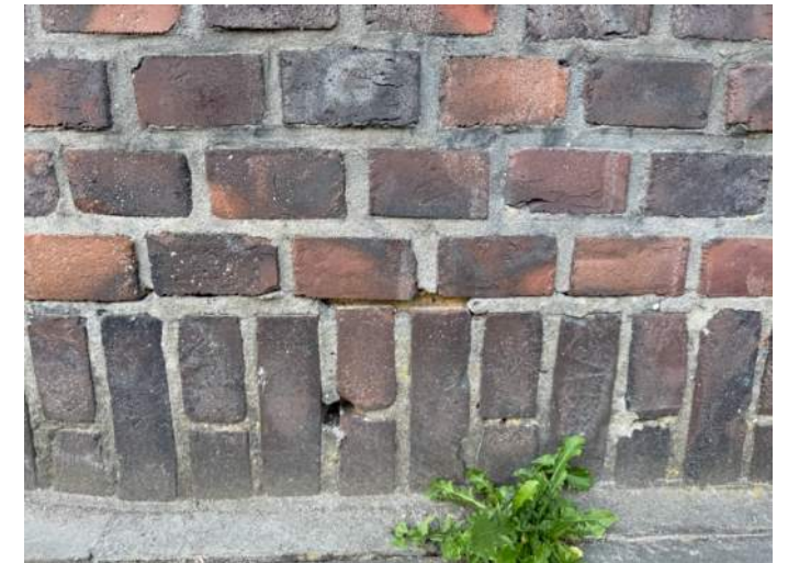
Afb. 5.3.12, loszittend, uitgevallen te hard voegwerk gevel 05, vermoedelijk originele (kleur) legmortel zichtbaar
