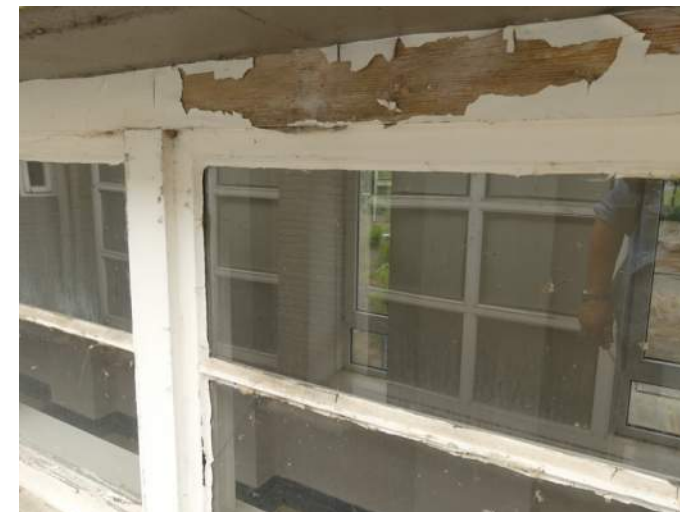
Afb. 5.10.12, afgebladderde verf, gevel 26
