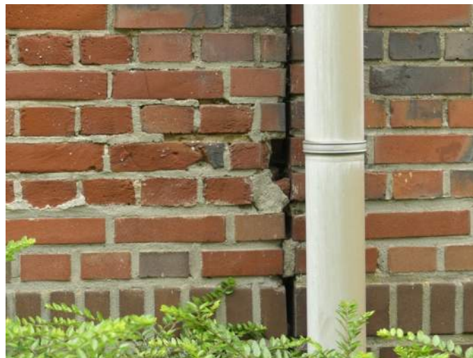
Afb. 5.3.20, defect metselwerk en ongelijke lagen aan beide zijden van de dilatatie, gevel 11
