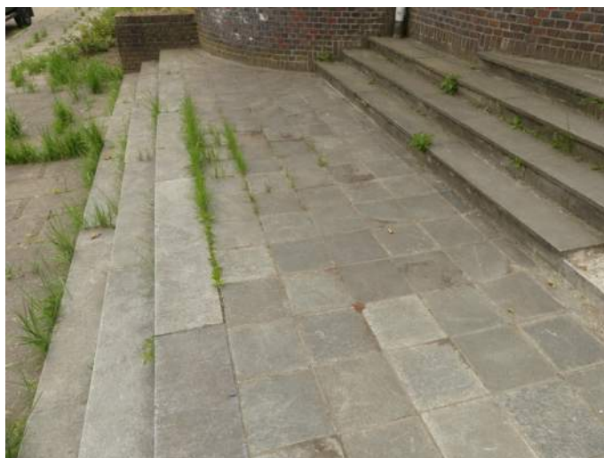
Afb. 5.8.01, verzakt tegelwerk en begroeiing tussen traptreden, bordes 01
