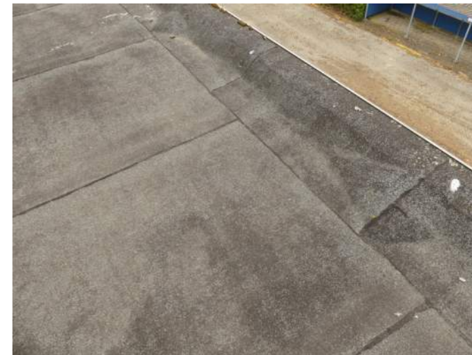
Afb. 5.6.31 blaasvorming onder mastiek, dak 11
