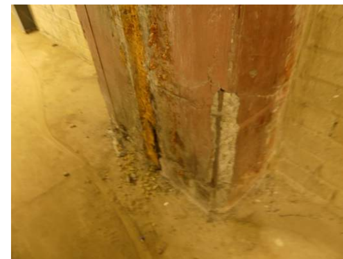
Afb. 5.12.12, afgefallen hoek pilaar, vermoedelijk te weinig betondekking op de wapening
