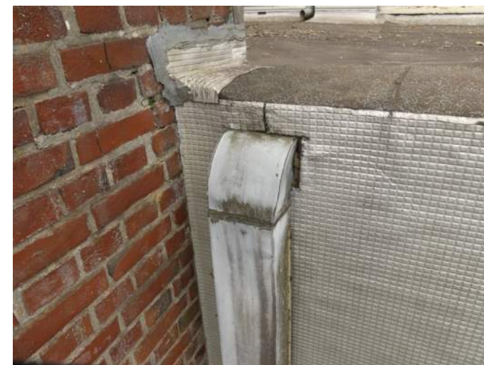
Afb. 5.11.03, versleten zink, uitgezakte aansluiting hwa en, foutieve aansluitingen, dak 02
