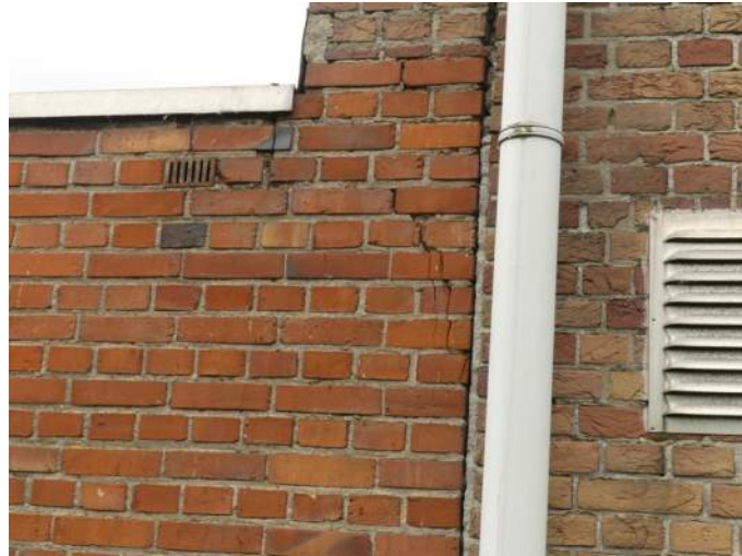
Afb. 5.3.18, gescheurd metselwerk, gevel 11
