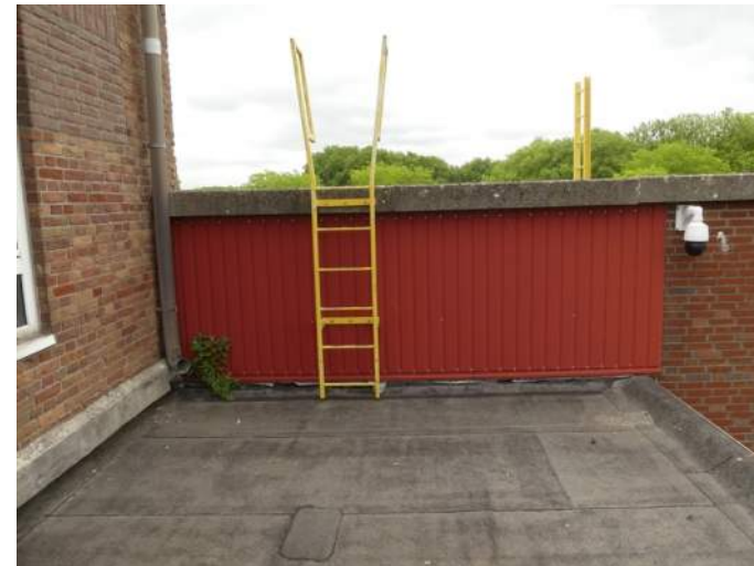
Afb. 5.5.01, dakladder voldoet niet aan veiligheids- dan wel arbo-voorschriften, gevel 19
