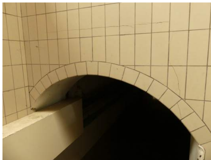
Afb. 5.12.02, gescheurd tegelwerk (en muur?) boven keldertrap
