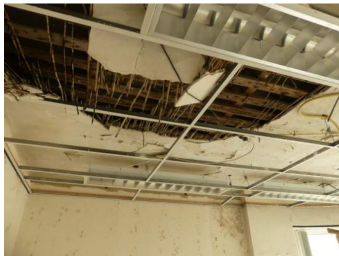
Afb. 5.12.18, zwaar beschadigd origineel stuc-op-rietplafond achter vervallen systeemplafond
