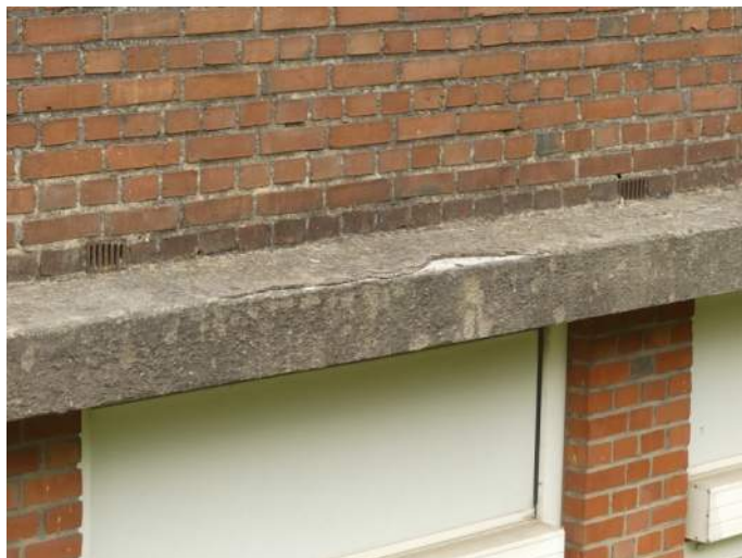
Afb. 5.9.05, verroeste ventilatieroosters boven betonlatei, gevel 11
