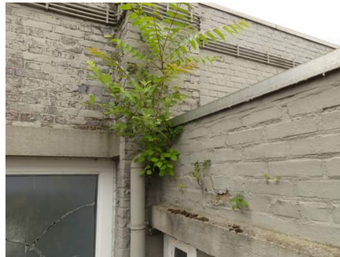
Afb. 5.3.30, begroeiing in metselwerk, gevel 25
