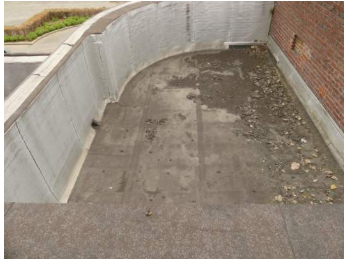
Afb. 5.6.02, vervuild, blaasvorming en foutieve aansluitingen, dak 02
