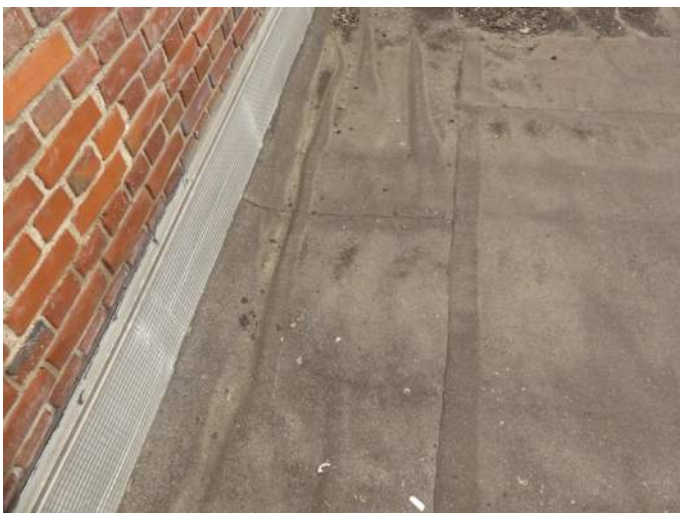
Afb. 5.6.05, blaasvorming en foutieve aansluitingen, dak 03
