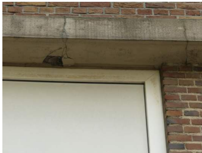
Afb. 5.2.06, scheuren in latei en afgebroken dekking
