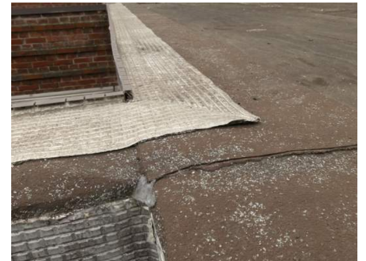
Afb. 5.6.08, slecht hechtende foutieve aansluiting, dak 04
