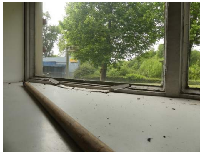
Afb. 5.7.04, weggevalen stopverfzoom, begane grond
