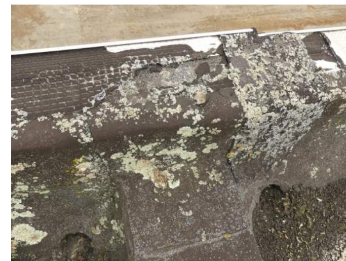
Afb. 5.6.36, verstopte doorvoeren bij dilatatie, versleten mastiek en ontzette, defecte daktrim, dak 13
