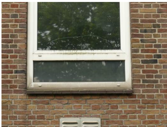
Afb. 5.7.01, gescheurde binnenruit, gevel 11
