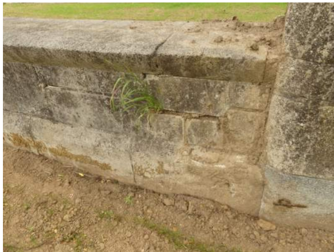
Afb. 5.1.01, loszittend en uitgevallen voegwerk
