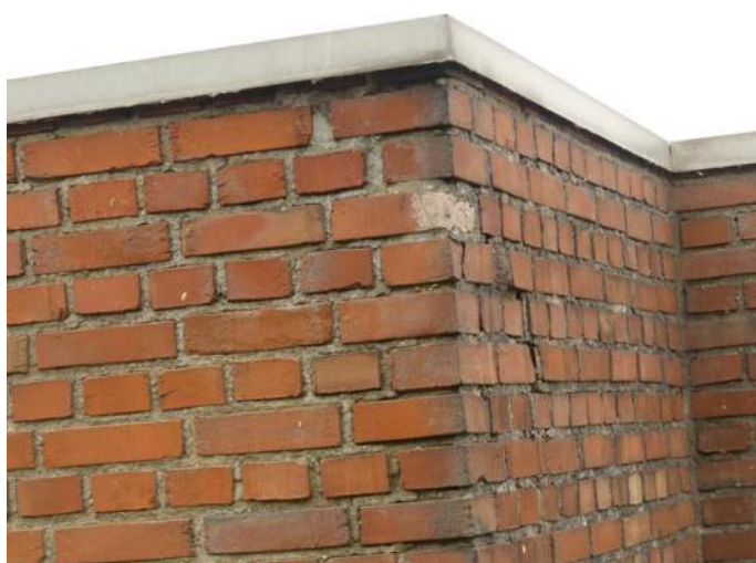
Afb. 5.3.17, gedefformeerd en slecht hersteld metselwerk, gevel 11
