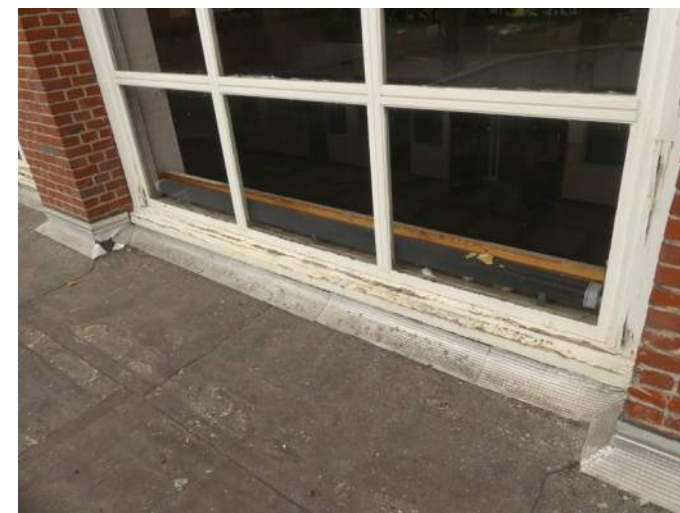
Afb. 5.4.03, vervalde onderdorpel, gevel 04
