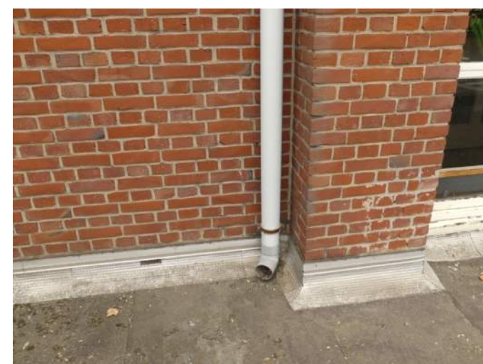
Afb. 5.11.05, PVC hwa met roestende beugels, gevel 06 uitgezakte hwa, dak 03
