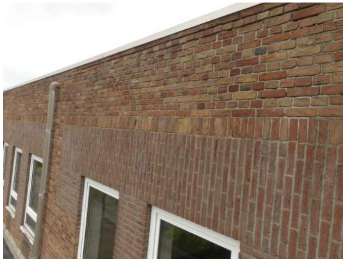
Afb. 5.3.29, uitgespoeld voegwerk onder dakrand, gevel 18
