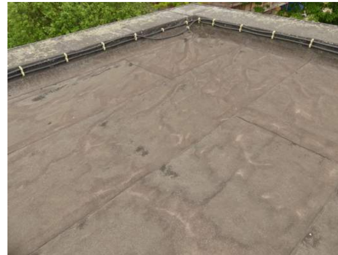
Afb. 5.6.11, plooivorming en leidingen door dakbedekking heen en losgezakte leidingen, dak 05
