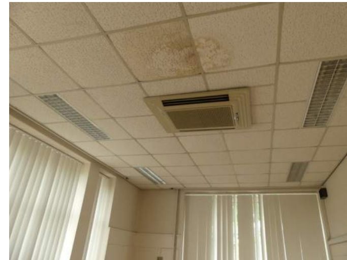
Afb. 5.12.33, lekkagesporen in systeemplafond
