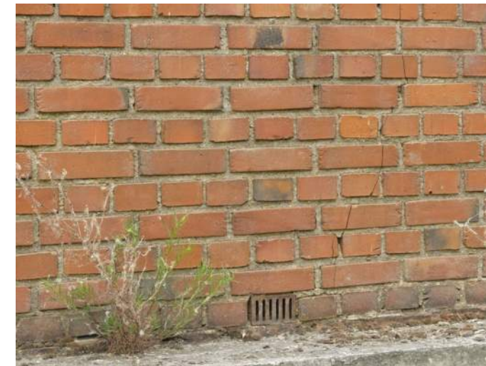
Afb. 5.3.22, gescheurd metselwerk boven betonlatei en roestende ventilatieroosters, gevel 11
