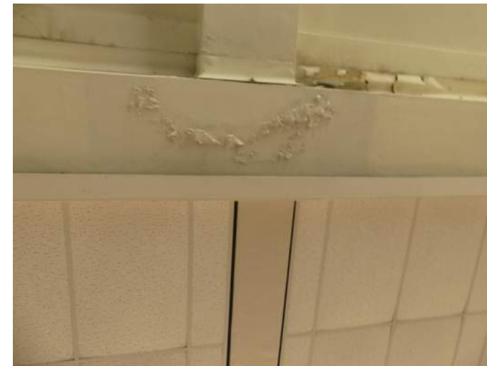
Afb. 5.12.45, lekkageschade op plafondbalken
