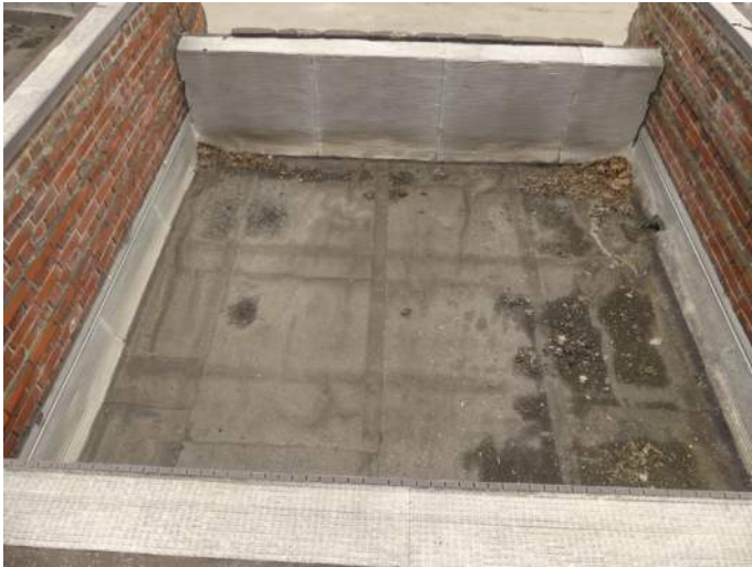
Afb. 5.6.01, vervuild, blaasvorming, en foutieve aansluitingen, dak 01
