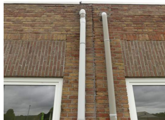
Afb. 5.3.25, uitgevallen dilatatiedichting, gescheurd metselwerk, en uitgevallen voegwerk, gevel 18
