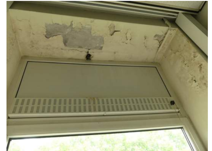
Afb. 5.12.32, ernstige lekkage boven kozijnen
