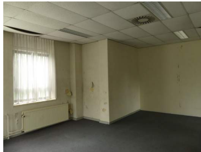
Afb. 5.12.52, afbladderende verf, uitgezakt systeemplafond
