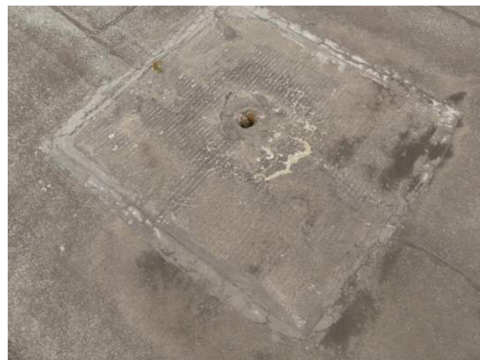
Afb. 5.6.30, versleten dakbedekking rondom doorvoer, dak 10
