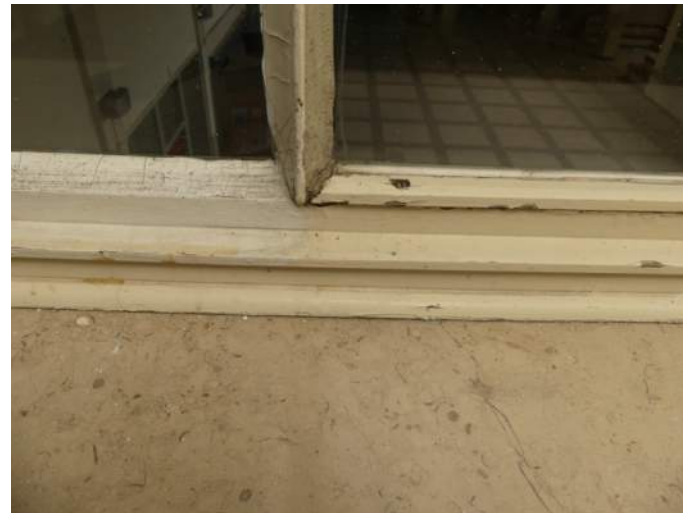
Afb. 5.12.40, beschadigde glaslatten en stopverf in stalen binnenkozijnen
