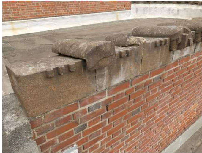
Afb. 5.3.04, vervuiling en losliggende en afgebroken delen
