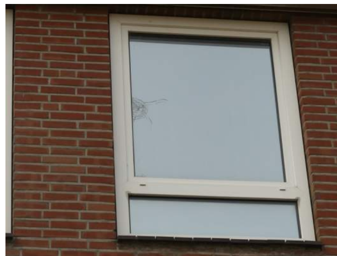
Afb. 5.7.02, beschadigde buitenruit, gevel 13
