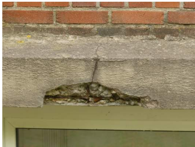
Afb. 5.2.08, door roestende wapening afgebroken dekking en grindnesten
