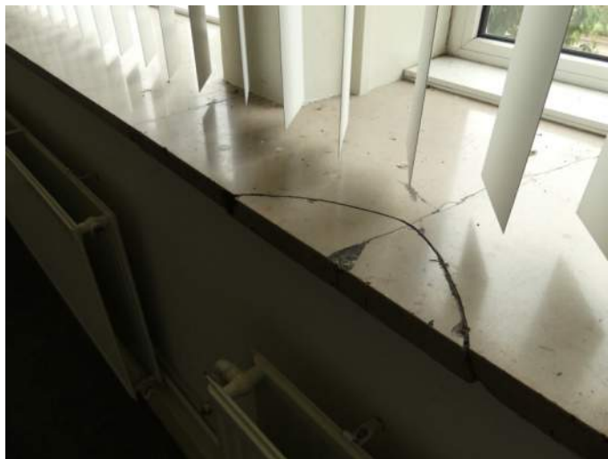
Afb. 5.12.15, gebroken en beschadigde natuursteen vensterbanken, verspreid over gehele begane grond
