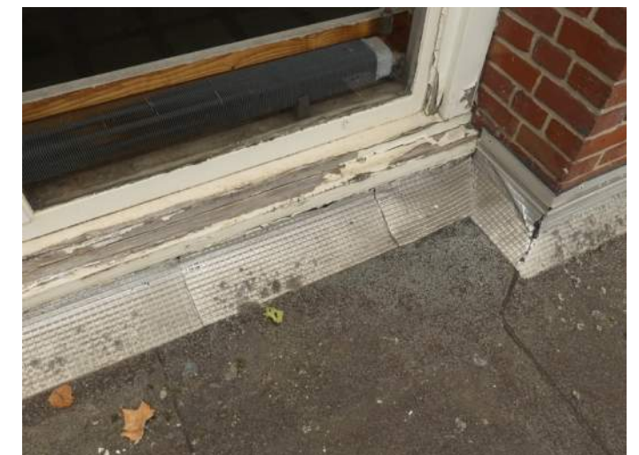
Afb. 5.4.04, (deels) uitgewaterde onderdorpel, gevel 06
