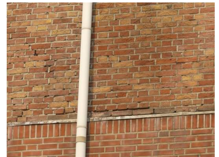
Afb. 5.3.14, loszittend, uitgevallen voegwerk gevel 12
