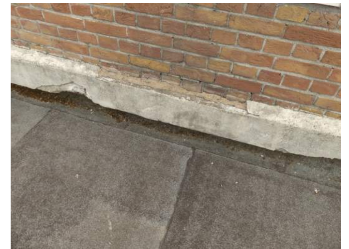
Afb. 5.2.12, afgefallen smeerlaag en afgebroken rand
