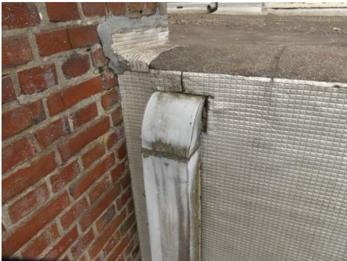
Afb. 5.6.03, versleten zink, uitgezakte aansluiting hwa en foutieve aansluitingen, dak 02
