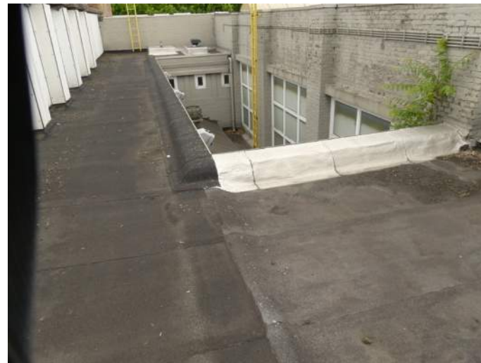
Afb. 5.6.26, blaasvorming en slechte aansluiting, dak 09
