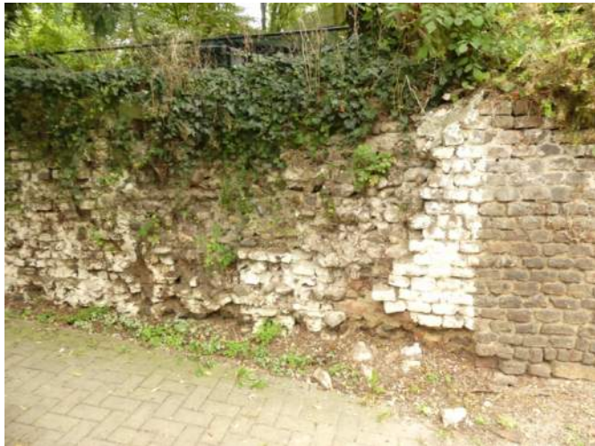
Afb. 05.07, begroeiing, uitgevallen voeg- en metselwerk
