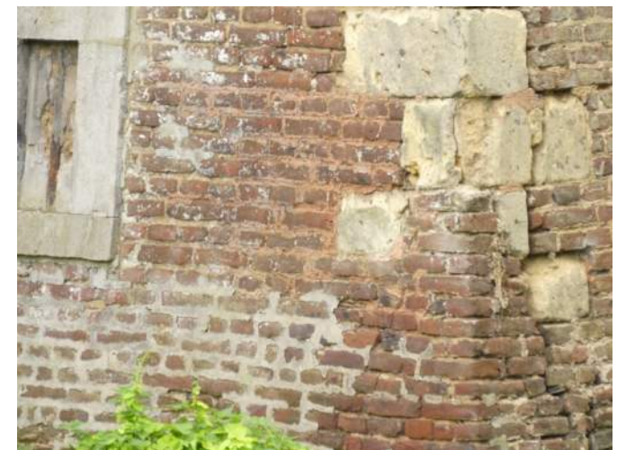
Afb. 01.16, gescheurde hoek toren 3
