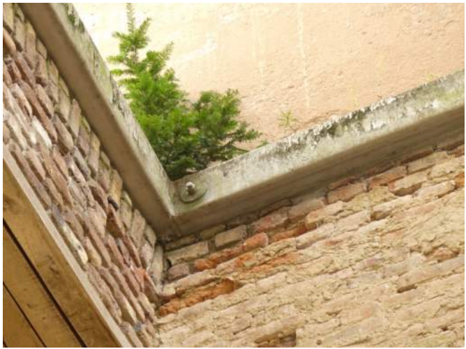
Afb. 01.27, begroeiing op balken, gescheurde stenen
