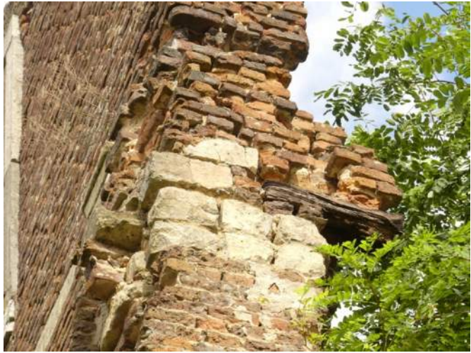
Afb. 01.22, afgeschilferd, gescheurd, weggevalen metselwerk
