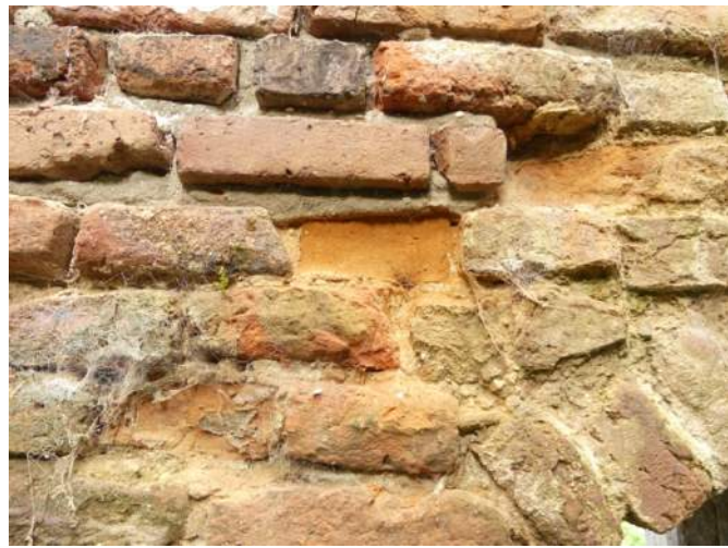
Afb. 01.19, afgeschilferde steen in te harde (cement-)mortel
