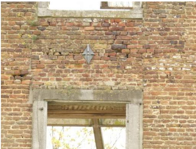
Afb. 01.09, uitgespoeld voegwerk en loszittend metselwerk
