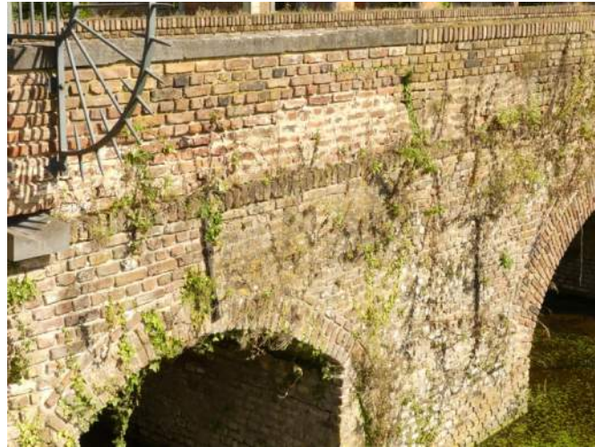
Afb 02.02 zijwang brugmuur met vegetatie en open voegwerk
