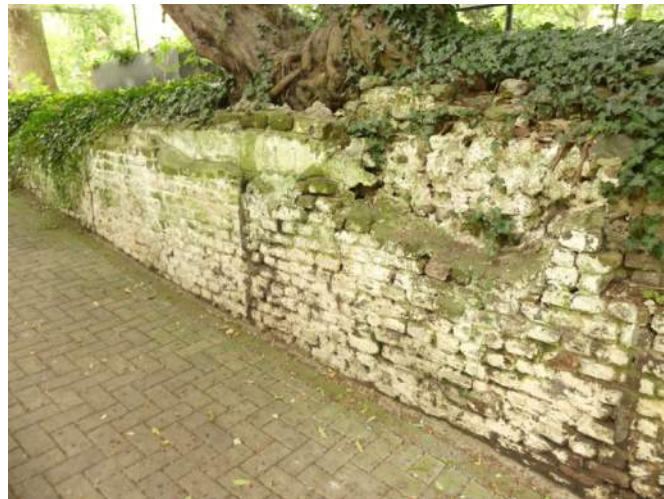
Afb. 05.08, begroeiing, uitgevallen voeg- en metselwerk
