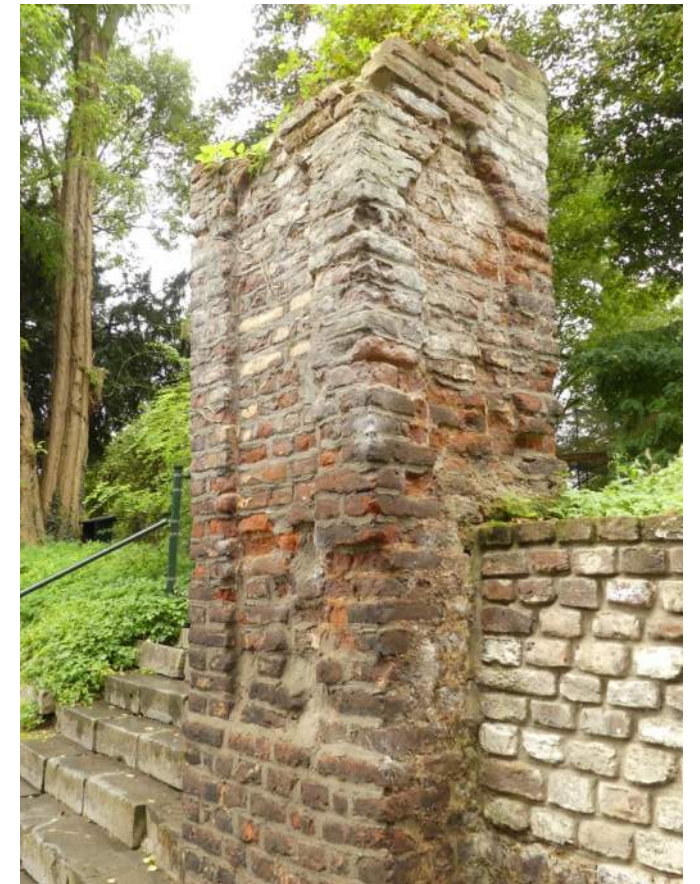
Afb. 05.02, penant met afgeschilferde stenen en gescheurd voegwerk
