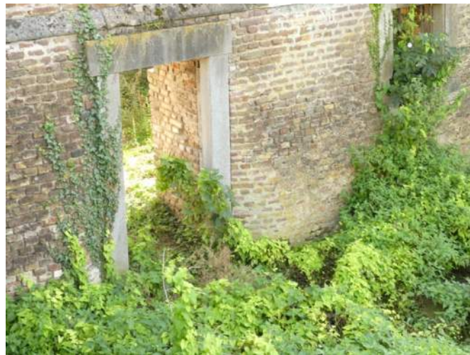
Afb. 01.12, uitgespoeld voegwerk en loszittend metselwerk
