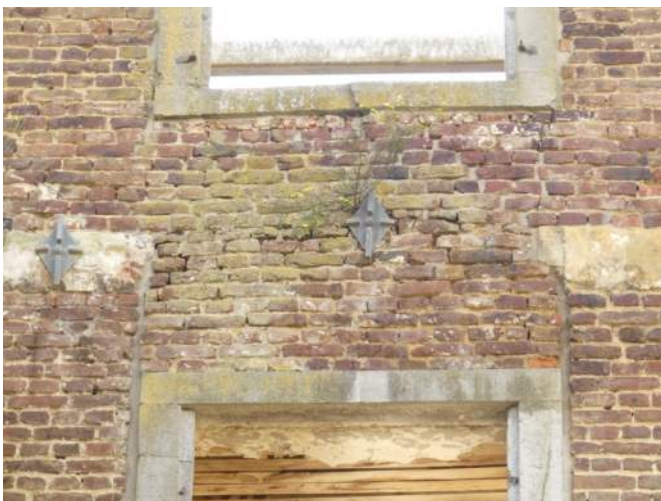
Afb. 01.11, uitgespoeld voegwerk en loszittend metselwerk
