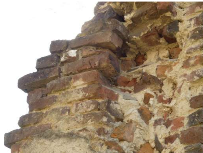
Afb. 01.13, afgefallen en loszittend metselwerk
