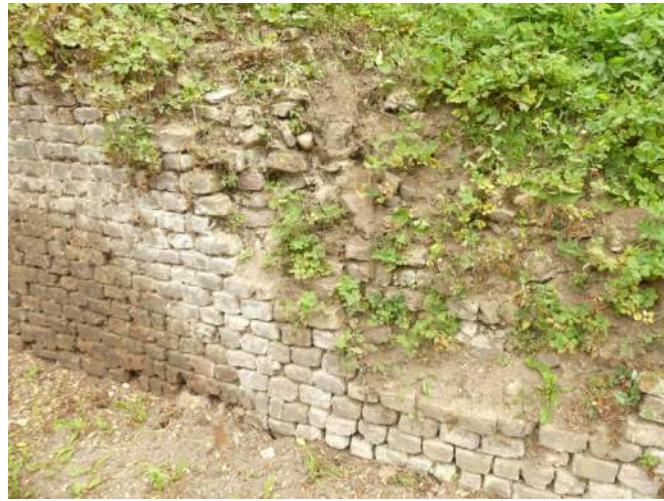
Afb. 05.06, begroeiing, uitgevallen voeg- en metselwerk
