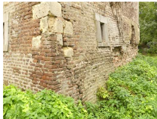
Afb. 01.17, gescheurde hoek en weggefallen gevelvlak
