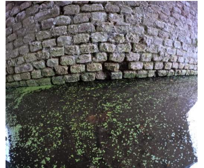
Afb. 02.10, uitgevallen voegwerk waterlijn
