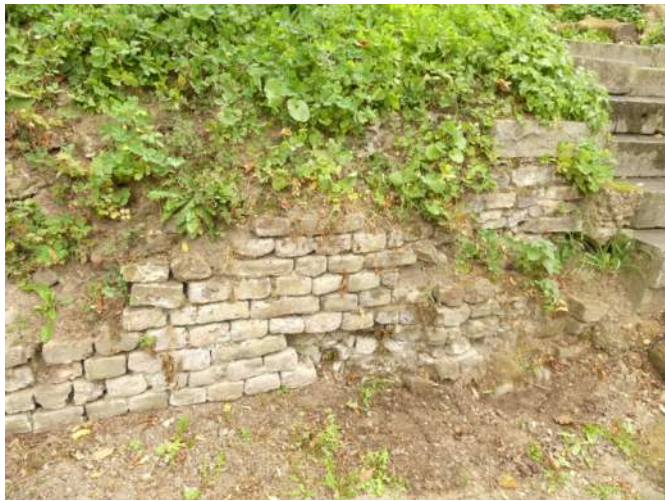
Afb. 05.05, begroeiing, uitgevallen voeg- en metselwerk
