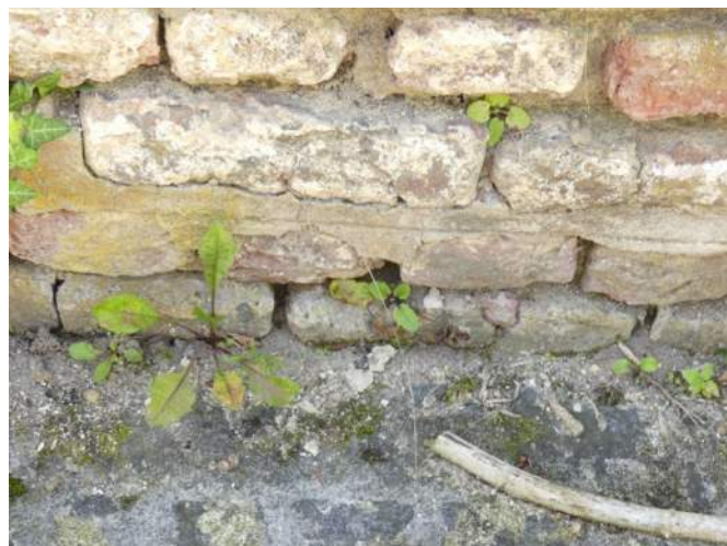
Afb. 02.06, losgescheurd en uitgespoeld voegwerk
