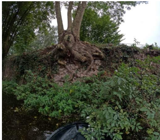
Afb. 04.07, detail wortelschade, afgedrukt metselwerk
