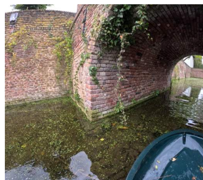
Afb. 02.11, uitgevallen voegwerk, vegetatie en begroeiing
