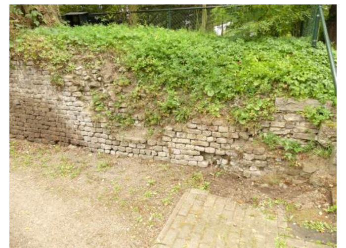
Afb. 05.04, begroeiing, uitgevallen voeg- en metselwerk
