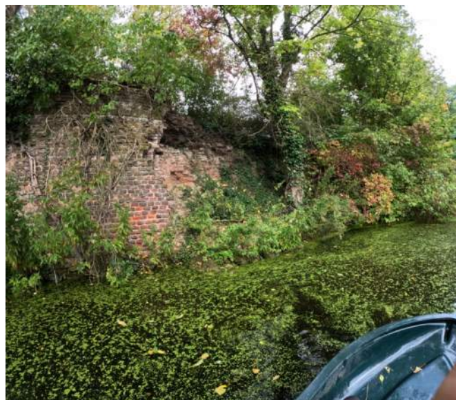
Afb. 04.10, weggefallen muurdeel door worteldruk
