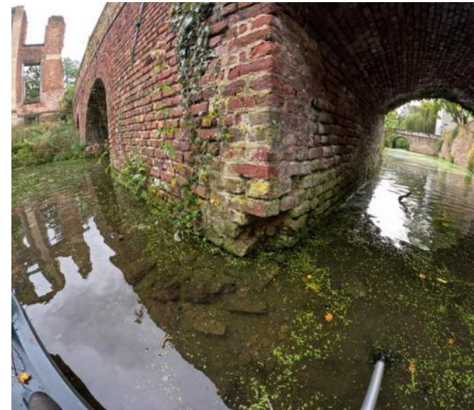
Afb. 02.09, weggefallen metselwerk eerste brugboog
