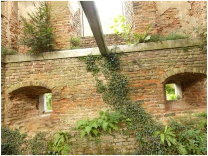
Afb. 01.28, begroeiing op balken, gescheurde stenen
