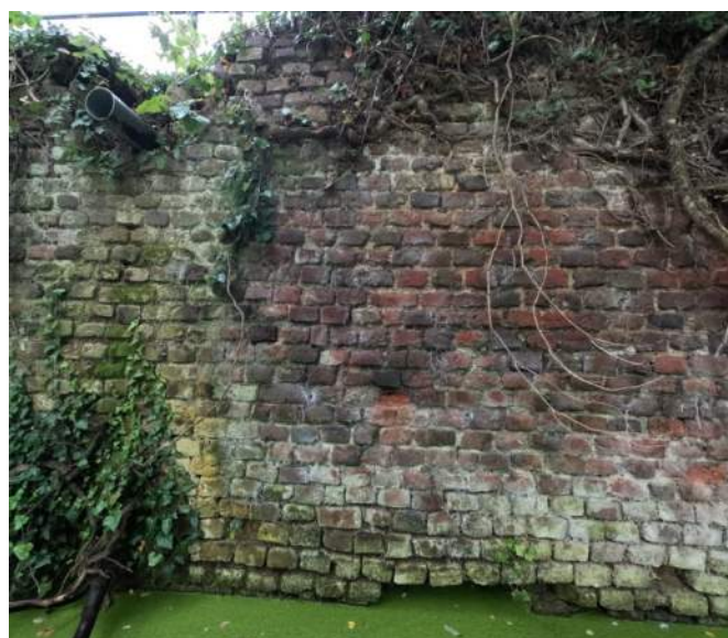
Afb. 04.12, loszittende en uitgevallen stenen en voegwerk
