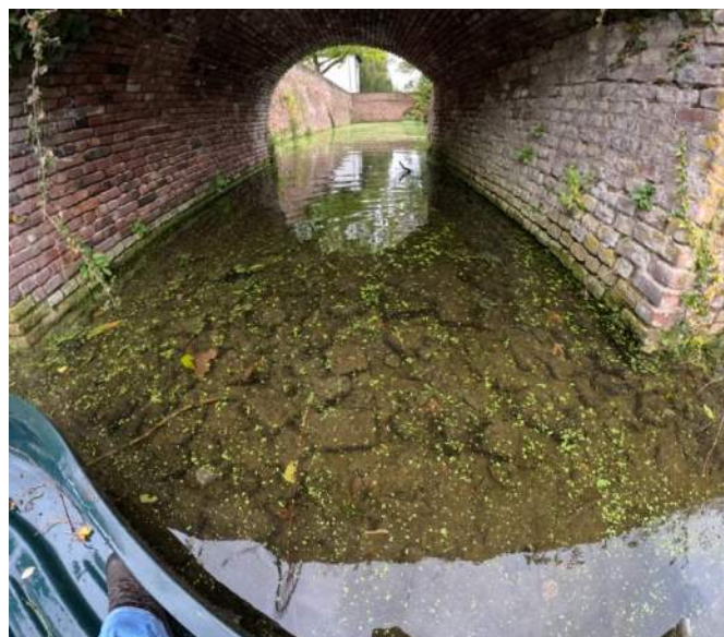
Afb. 03.03, puin eerste brugboog
