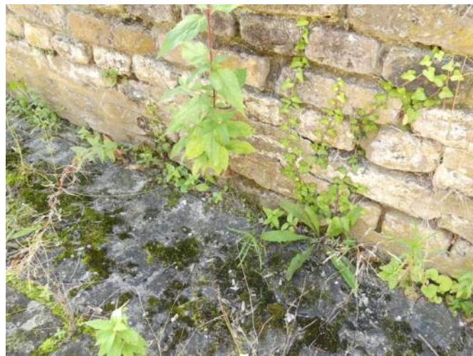
Afb. 02.05, vegetatie en beschadigd muurwerk
