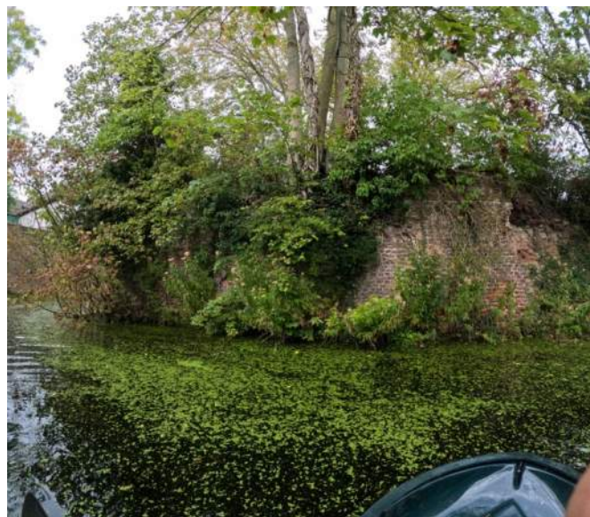
Afb. 04.09, weggefallen muurdeel door worteldruk
