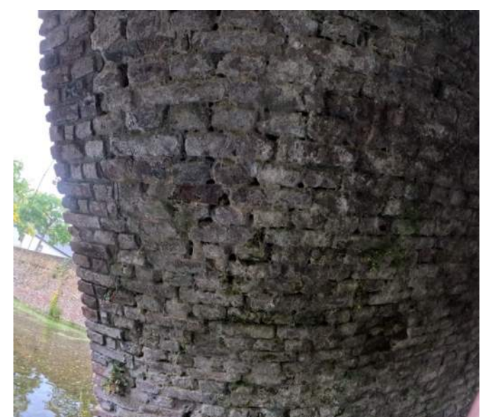
Afb. 02.12, uitgevallen, loszittend voegwerk, scheurvorming
