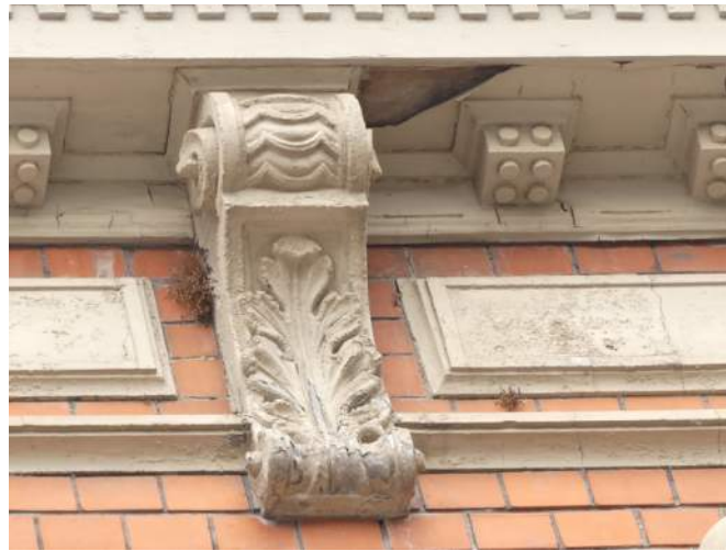
Afb. §46.23.04, degraderende, verpoederende verf op cosole
