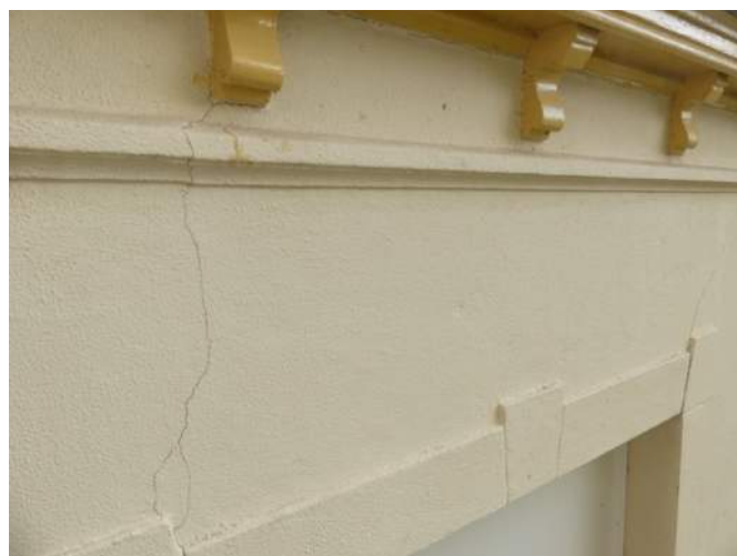
Afb. §22.18 scheuren achtergevel
