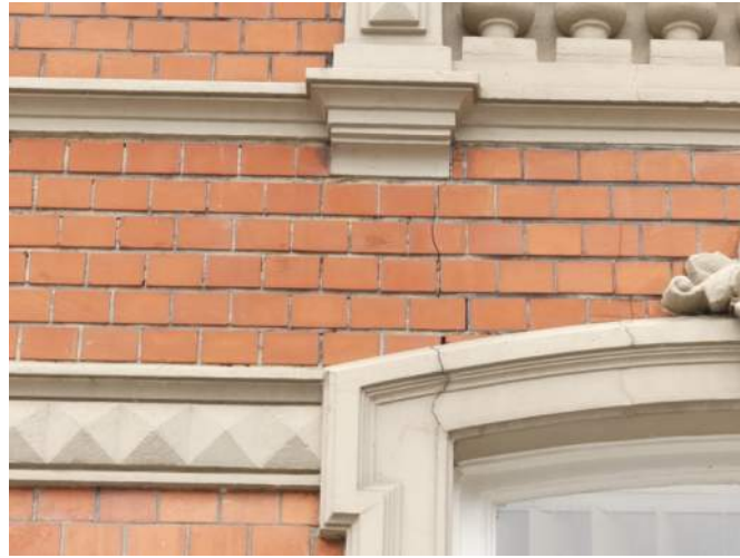
Afb. §22.01 scheuren tussen beletage en verdieping
