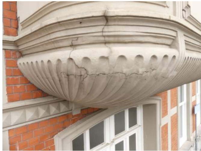
Afb. §40.26, scheuren in kuip en borstwering
