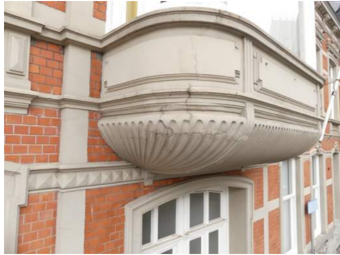
Afb. §40.24, zijaanzicht erker met enige locatie scheuren in de kuip
