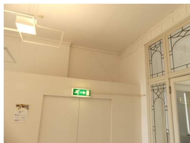
Afb. §22.21 gescheurde binnenmuren
