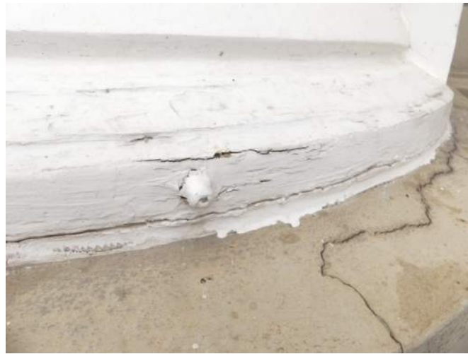
Afb. §46.21.26, gebarsten en onthechte verf, erker
