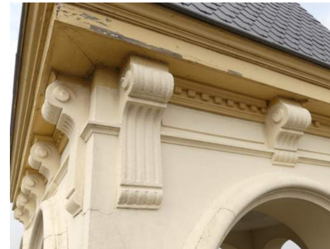
Afb. §24.19, gebarsten neuslijst bakgoot toren
