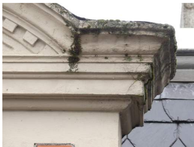
Afb. §35.30, openstaand dakleer met vervuiling eronder en scheuren
