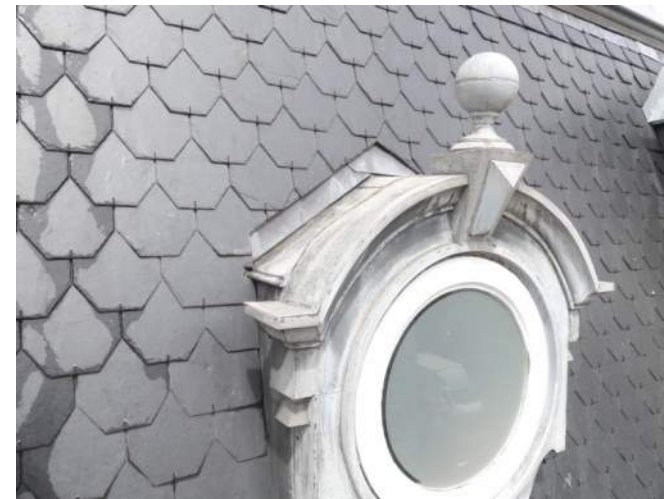
Afb. §33.51.09, foutieve leihaken ('klembeek' wordt in Nederland alleen bij vezelcementleien toegepast)
