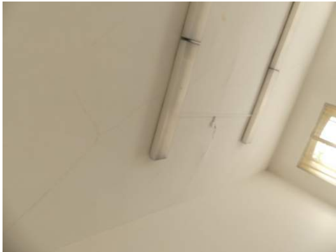
Afb. §40.49, scheuren en loszittend stucwerk
