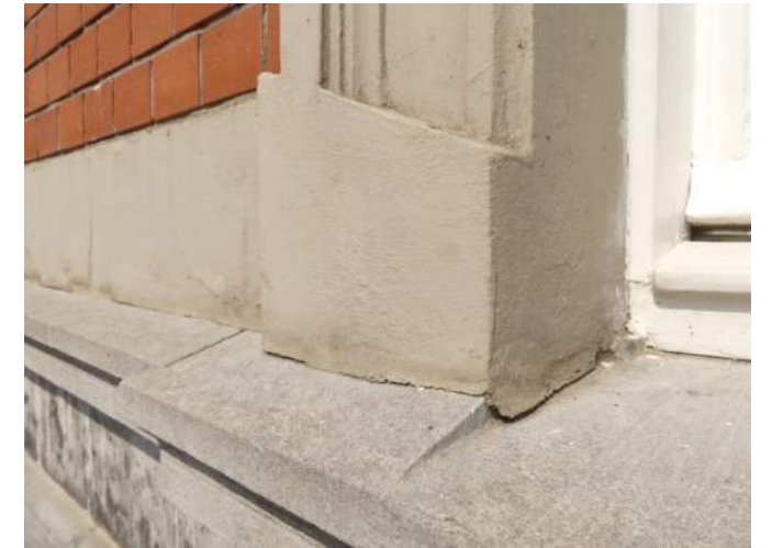
Afb. §46.23.10, degraderende, verpoederende en vochtbelaste verf op onderste gevellijst, in plakken loslatend
