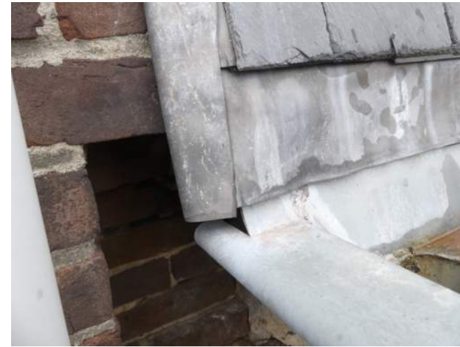
Afb. §33.87.09, slecht uitgevoerd detail
