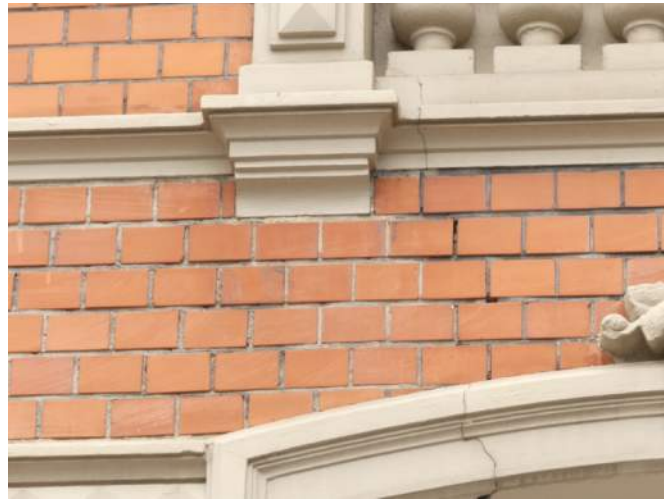
Afb. §22.03 scheuren tussen beletage en verdieping
