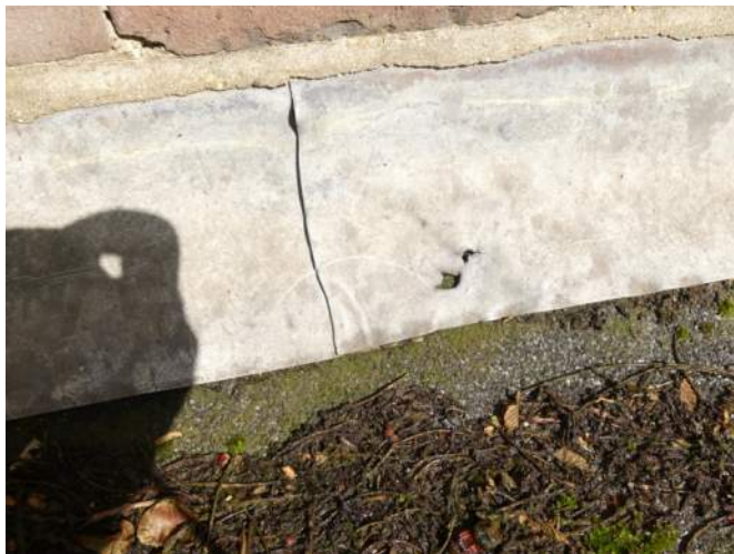
Afb. §33.87.27, gaatjes in oud lood boven vernieuwd plat dak
