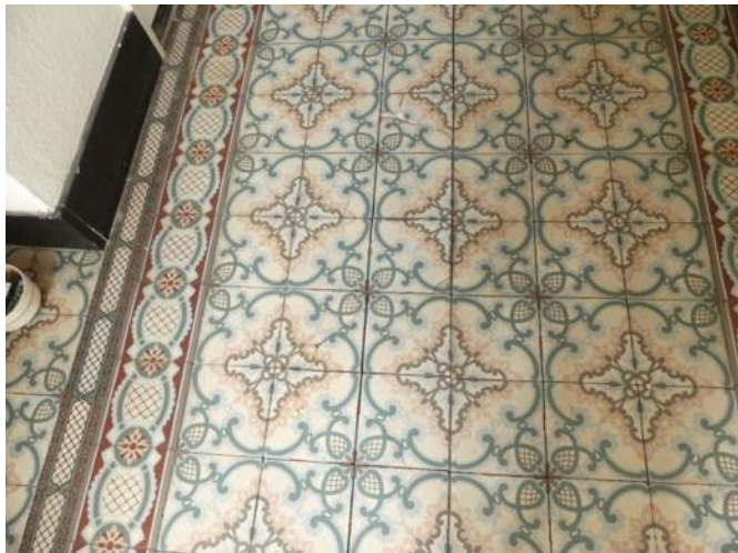
Afb. §41.03, gescheurde en gebroken tegels
