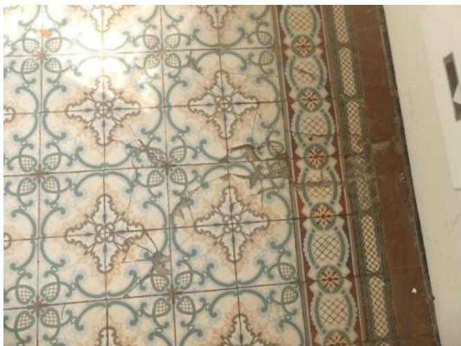
Afb. §41.05, gescheurde en gebroken tegels
