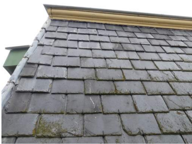
Afb. §33.51.17, weggevallen en gebroken leien
