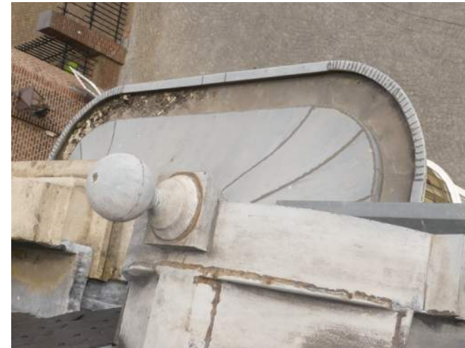
Afb. §50.09, erker-goot op donderdag, zonnig weer NB: aan de hoeveelheid blad boven in de foto lijkt afschot in orde te zijn
