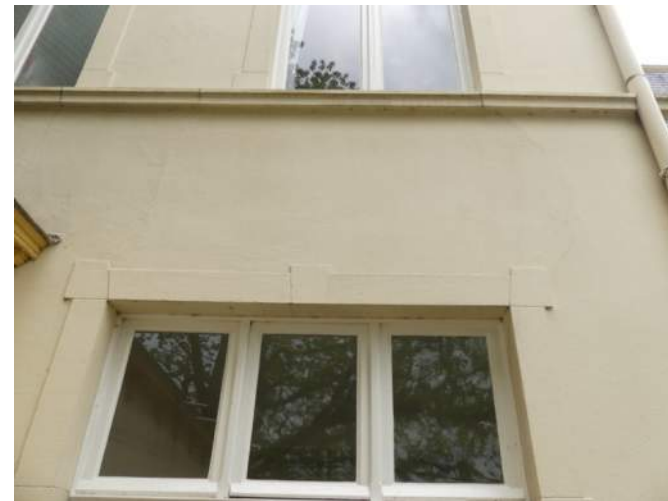
Afb. §22.15 scheuren achtergevel
