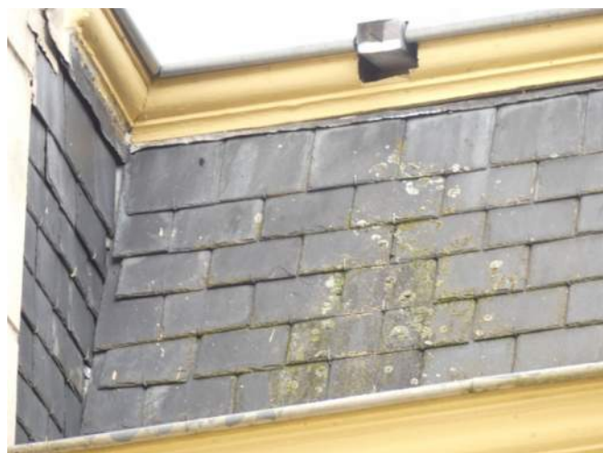
Afb. §33.51.27, foutief uitgevoerde kilgoot
