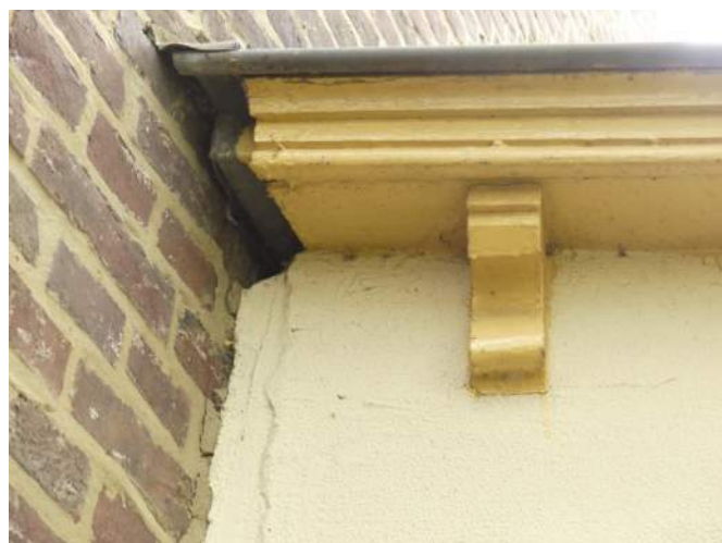
Afb. $50.16, bakgoot aanbouw, niet ondersteund
