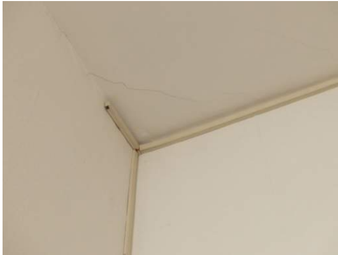
Afb. §40.47, gescheurd plafondstucwerk
