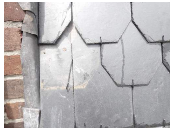
Afb. §33.51.11, door te steile lamme koppen en als voetlei een lamme kop-lei ondersteboven toe te passen, ontstaat een potentieel lek bij uitvallen lei, foutieve haak goed zichtbaar, nagel niet verzonken
