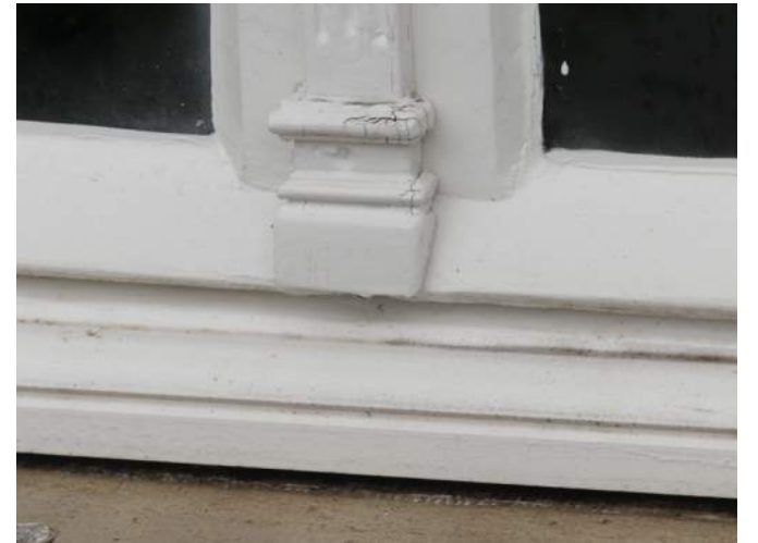
Afb. §46.21.22, barsten op detailwerk
