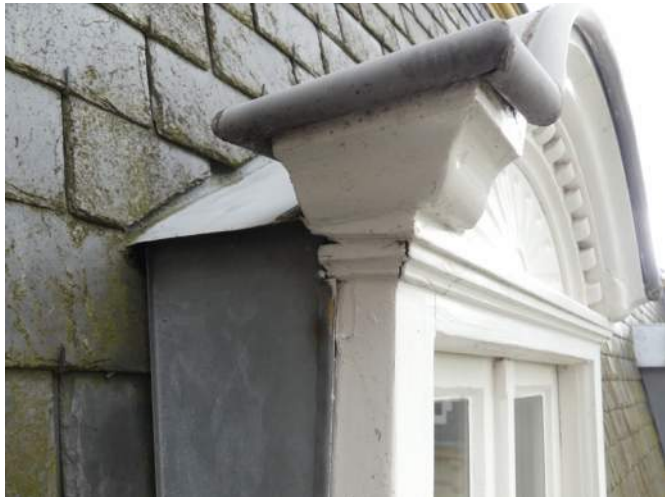
Afb. §33.87.45, openstaande aansluiting bekleding zijwang
