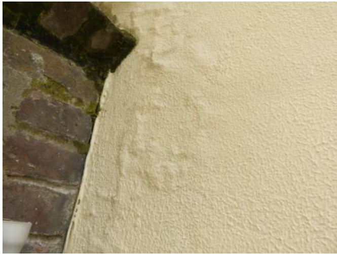
Afb. §46.23.15, vochtbelast verfwerk
