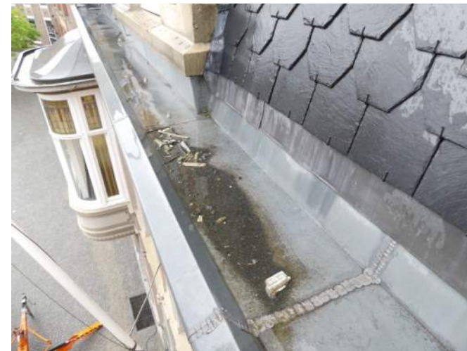
Afb. §33.87.39, goot niet op afschot, afwijkende neuslijst
