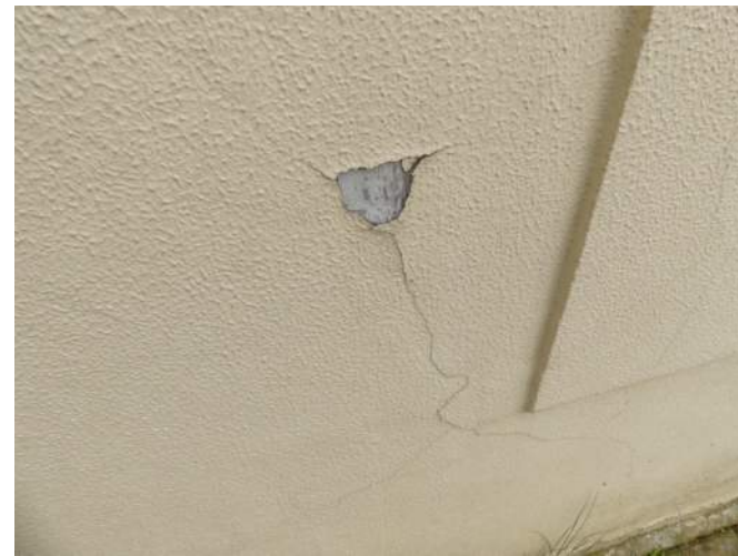
Afb. §46.23.23, gescheurde en loslatende verf
