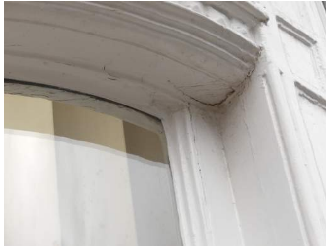
Afb. §46.21.28, ook aan onderzijde, minst weerbelast, barsten in verf
