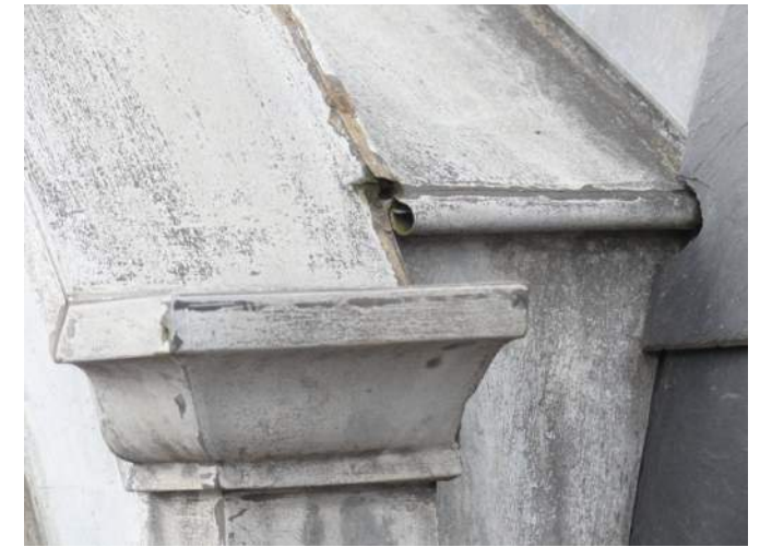
Afb. §33.87.38, opengescheurde versleten naden
