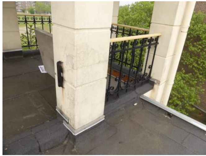
Afb. §46.23.14, vervuilde en afbladderende verf
