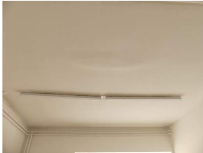
Afb. §40.48, loszittend en gescheurd stucwerk
