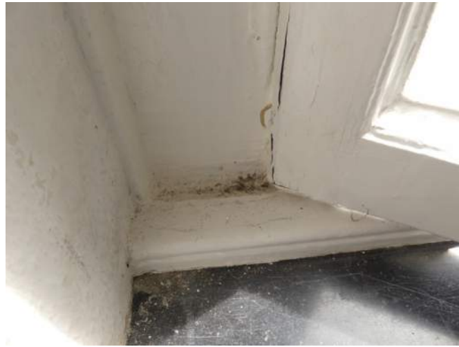
Afb. §30.24, scheuren in scharnierstijlen draairamen
