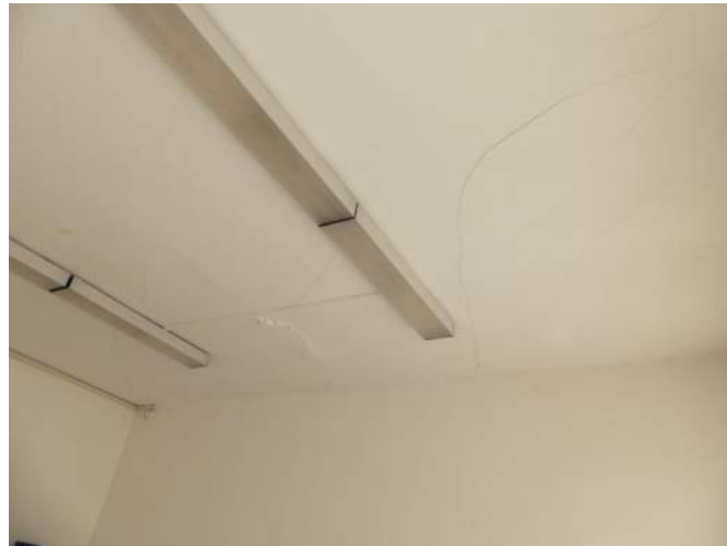
Afb. §40.50, scheuren en loszittend stucwerk
