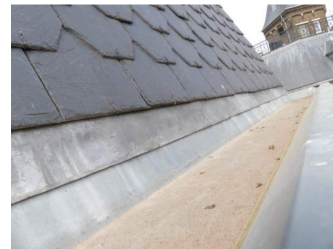
Afb. §33.51.36, ontbrekende en/of openstaande klemhaken (dus zonder functie)
