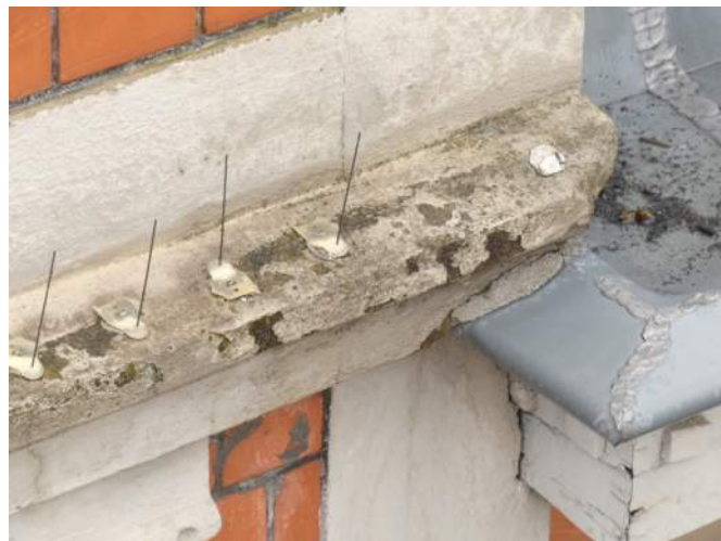
Afb. §40.05, afgebroken lijst hoek
