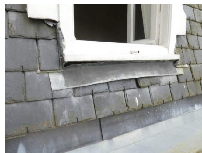
Afb. §33.87.23, losgezakt (onvoldoende bevestigd?) dorpellood, slordig gedetailleerd onderste indekllood
