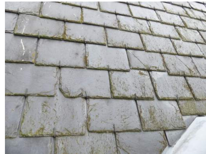
Afb. §33.51.21, weggevallen en uitgezakte leien, uitzakkende koperen leihaken
