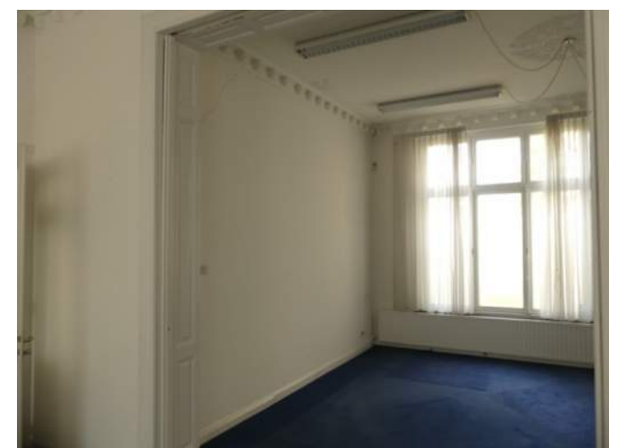
Afb. §22.22 gescheurde binnenmuren
