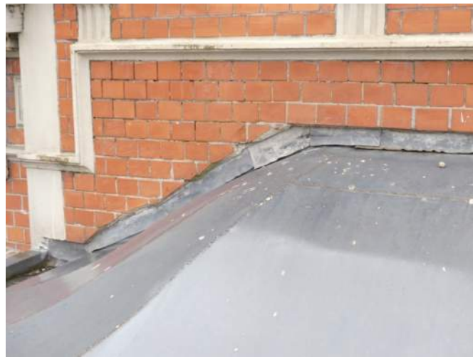
Afb. §33.87.03, onregelmatig muurlood
