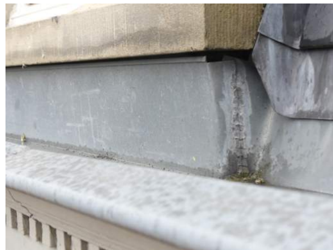
Afb. §33.87.14, ontbrekend lood èn felskant (waterkering) aan goot
