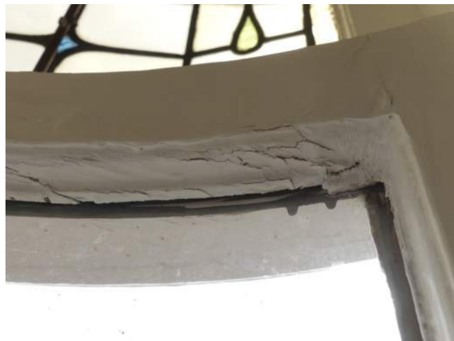
Afb. §46.21.30, gebarsten verf onderzijde kalf, weinig weerbelasting
