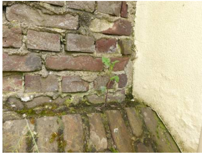
Afb. §46.23.16, vochtbelast verfwerk
