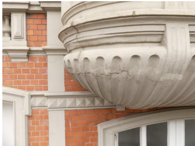
Afb. §40.27, iets wijkende scheuren in kuip en borstwering
