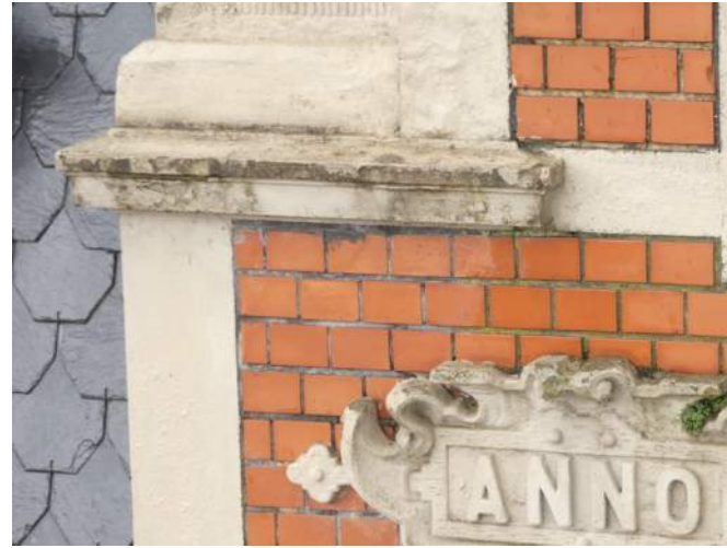
Afb. §40.02, vervormd en gescheurd pleisterwerk Vlaamse gevel
