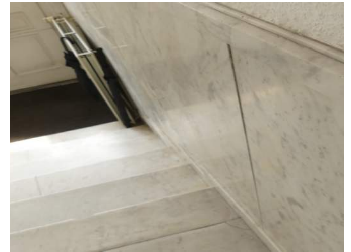
Afb. §35.44, lambrisering linkerwand, ongelijke platen
