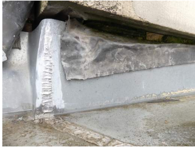
Afb. §50.02, ontbrekende waterkering aan achterzijde nieuwe gootbekleding
