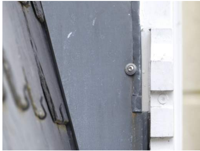
Afb. §33.87.44, vreemde bevestiging zijwang dakkapel in het zicht
