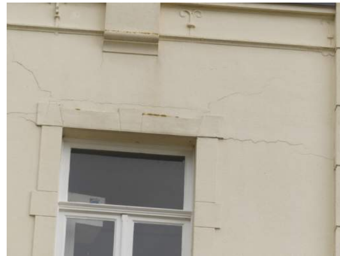
Afb. §46.23.22, vervuild en gescheurd verfwerk
