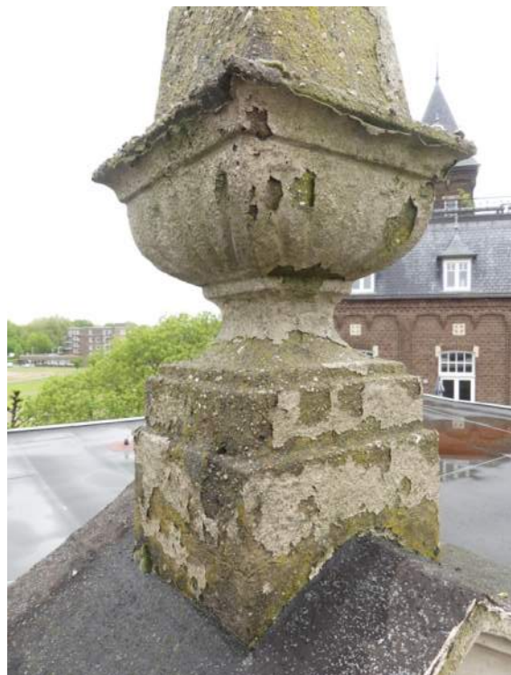
Afb. §35.17, beschadigde pinakelschacht
