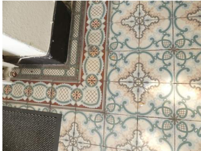
Afb. §41.02, gescheurde tegels en versleten voegwerk
