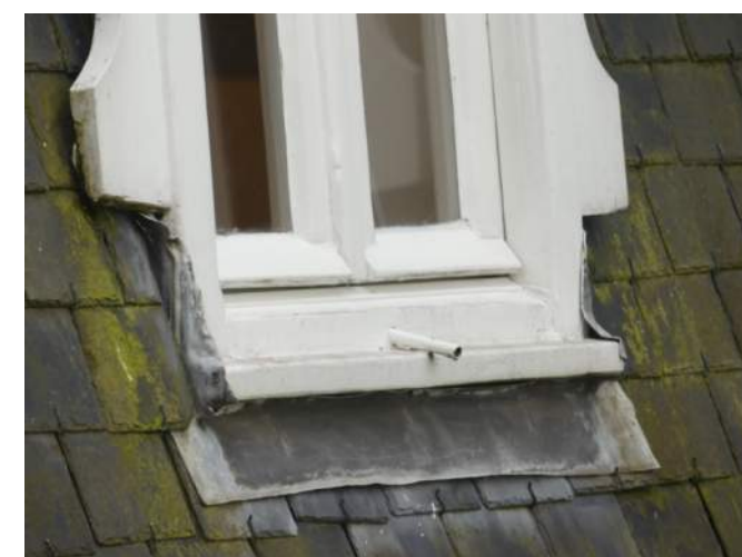
Afb. §33.87.24, losgezakt (onvoldoende bevestigd?) dorpellood, slordig gedetailleerd onderste indekllood
