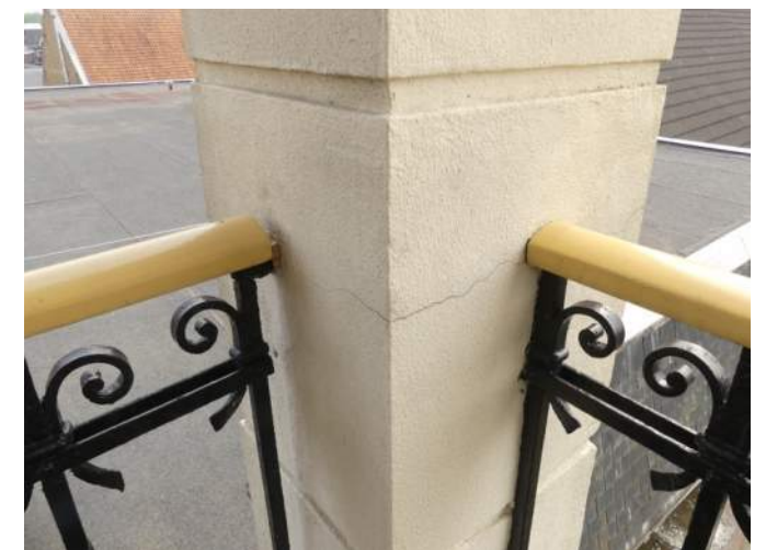
Afb. §43.08, (vermoedelijk) roestende bevestigingen van balustrade
