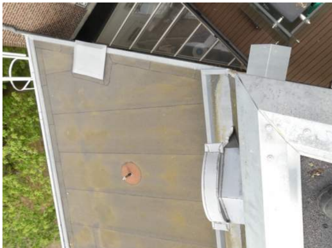
Afb. §33.87.51, drie schroeven in liggend werk hinderen werken Afdekkap, dichting met kit (?) – in ieder geval in de punt
