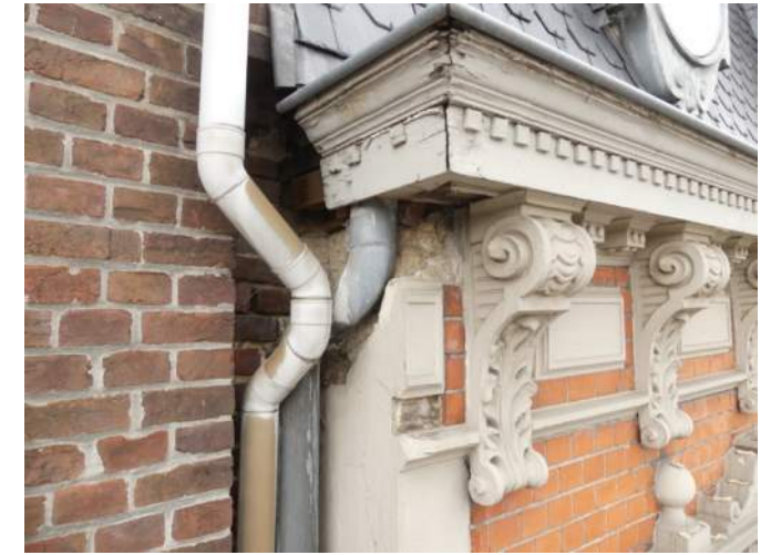
Afb. §24.08, afgenomen ornament, weggevalen blokjes, openstaande verbindingen
