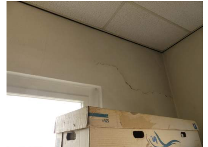
Afb. §40.42, gescheurd stucwerk tegen buitengevel toren
