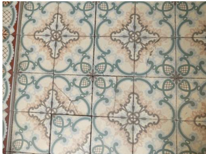
Afb. §41.04, gescheurde en gebroken tegels
