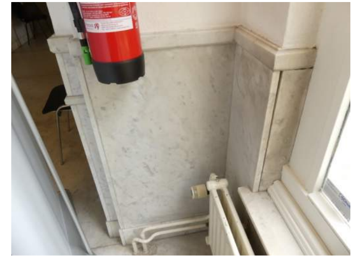
Afb. §35.56, verzakte wandpanelen
