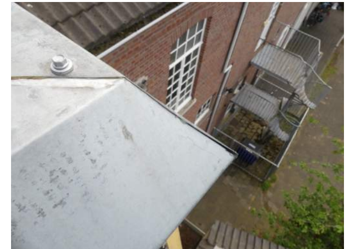
Afb. §33.87.54, in liggend werk geschroefd, neopreen ring is (al) aan het vergaan
