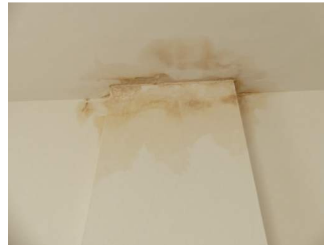
Afb. §40.45, door lekkage op schoorsteen vervuild stucwerk
