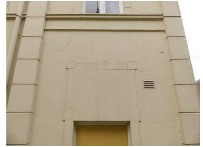
Afb. §46.23.20, gescheurd schilderwerk dichtgezette kozijn-sparing
