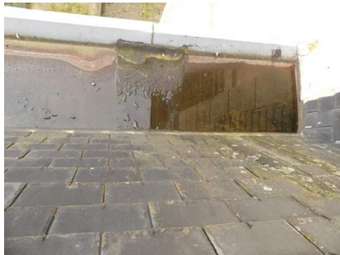
Afb. §33.87.48, dakje 'nieuwe' dakkapel niet op afschot
