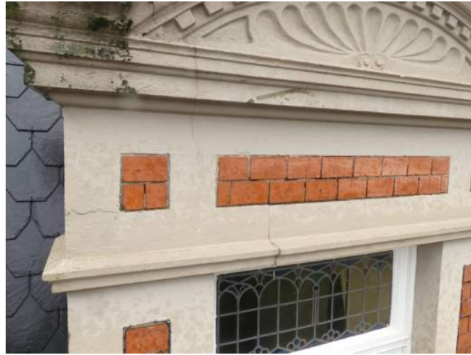
Afb. §40.01, gescheurde lijsten en banden dakkapellen
