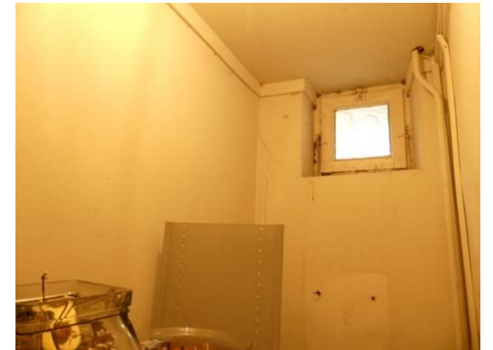
Afb. §40.44, gescheurd stucwerk tegen buitengevel
