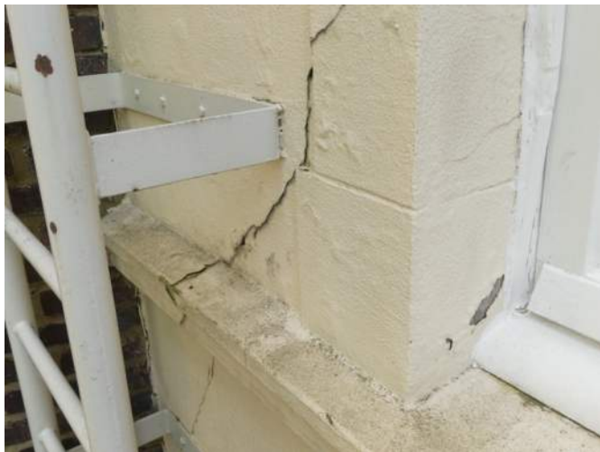
Afb. §46.23.17, vochtbelast verfwerk
