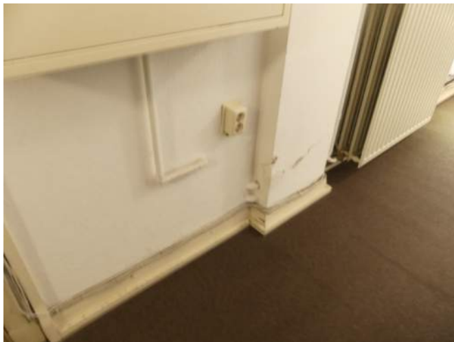
Afb. §40.37, scheur in stucwerk pilaster overloop
