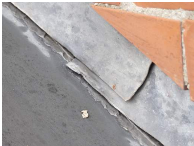
Afb. §33.87.05, niet aangeklopt te lang muurlood (capillair!), geen felsrand bij (voldoende) overlap
