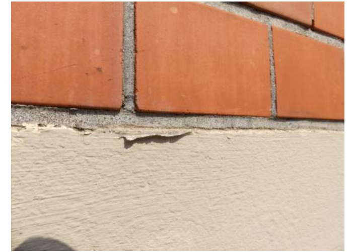
Afb. §46.23.08, door vochtbelasting (via voegmortel) afpellende, slecht hechtende, verf
