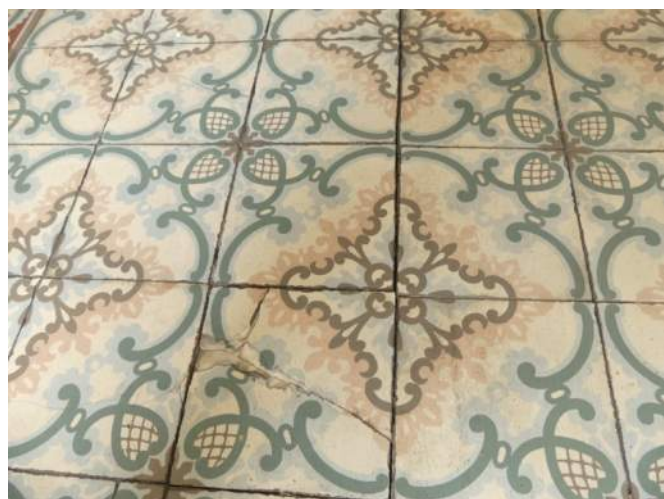
Afb. §41.06, gescheurde en gebroken tegels en versleten voegwerk
