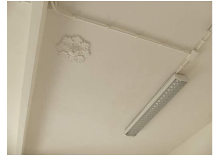
Afb. §40.54, loszittend stucwerk
