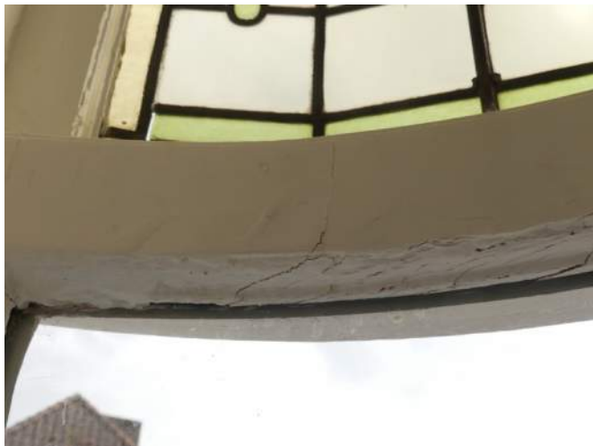
Afb. §46.21.29, gebarsten verf onderzijde kalf, weinig weerbelasting
