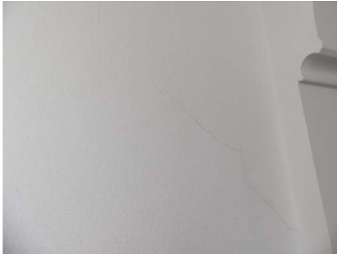
Afb. §40.35, scheur in stucwerk gang beletage
