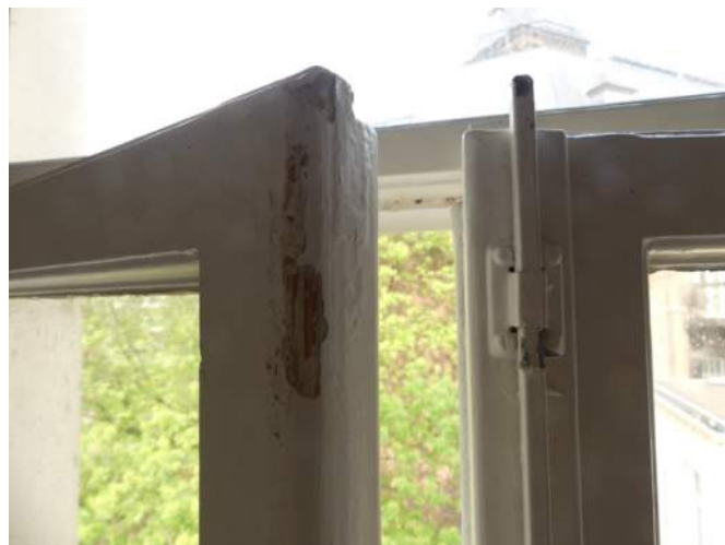
Afb. §46.21.38, afgesletten verf op stolpstijl
