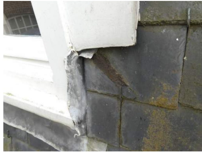
Afb. §33.87.26, onvoldoende sluitend, in het zicht genageld indeklod
