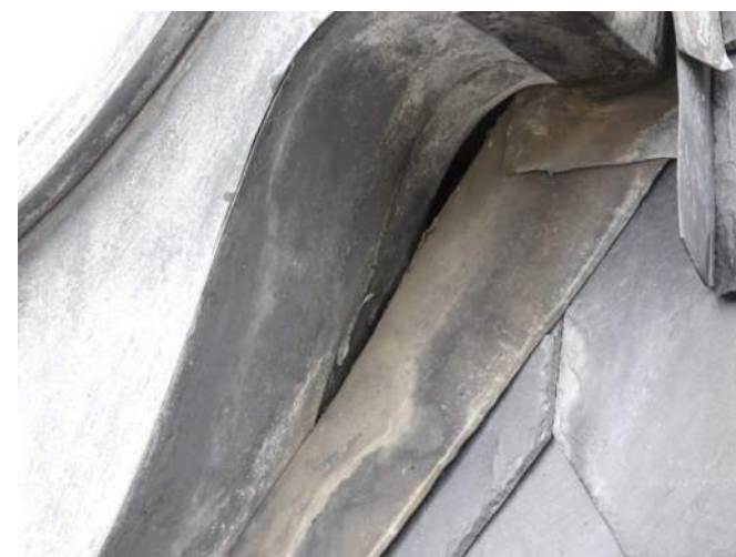
Afb. §33.87.21, bestaand lood onder oeil de boeuf, afsluiting onvoldoende
