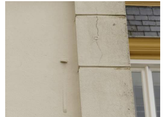
Afb. §46.23.22, vervuilde verf op hoek toren
