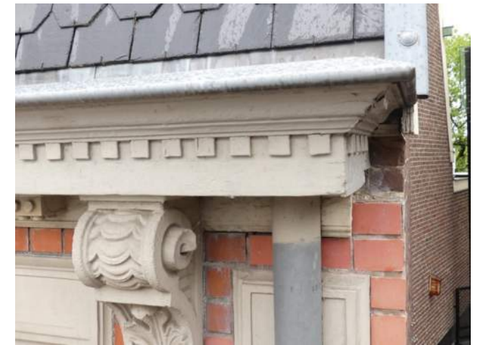
Afb. §46.21.08, afbladderende en verpoederende verf
