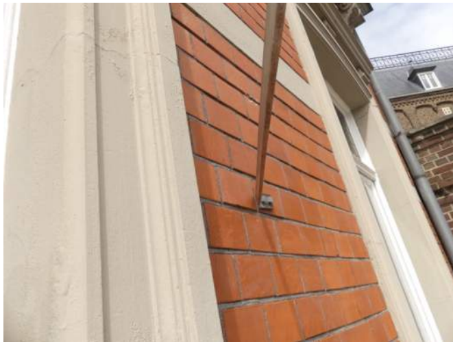
Afb. §46.23.05, verpoederende, gescheurde verf
