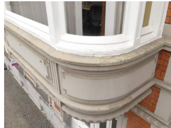
Afb. §40.33, scheuren in waterlijst borstwering
