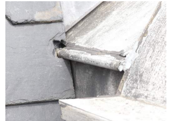
Afb. §33.51.10, onderzijde kraal rust op uitgeknipte lei, beter had hier meer speling gehouden en lood toegepast
