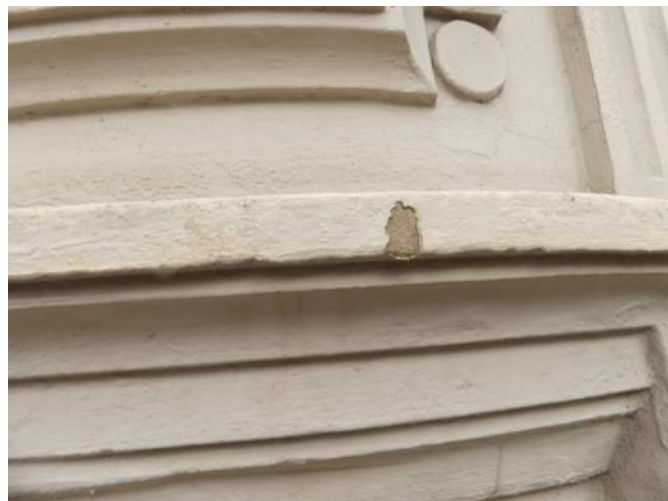
Afb. §40.28, beschadigd verfwerk en blaasvorming in keel-lijst borstwering
