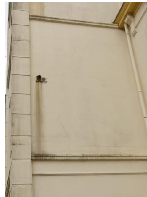
Afb. §46.23.11, vervuilde verf achtergevel, toren
