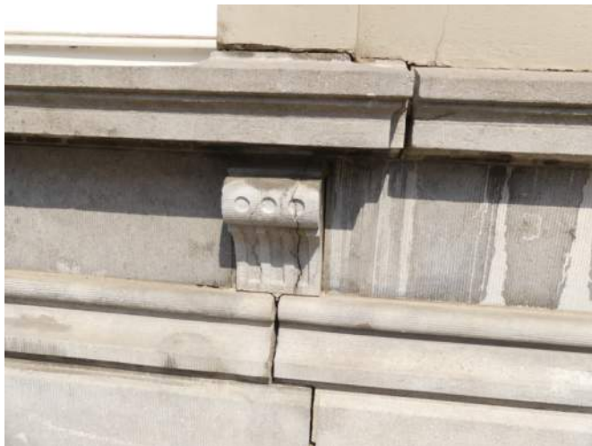
Afb. §35.03, uitgespoeld voegwerk (zetting?)
