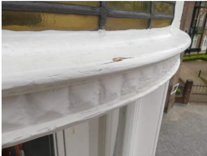
Afb. §46.21.27, te dikke verf op fijn gedetailleerd werk, barsten in verf en beschadiging
