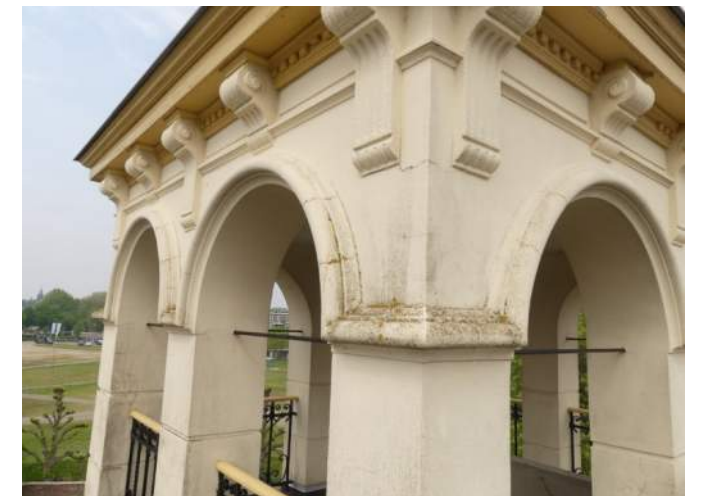
Afb. §46.23.12, vervuilde verf achtergevel, toren
