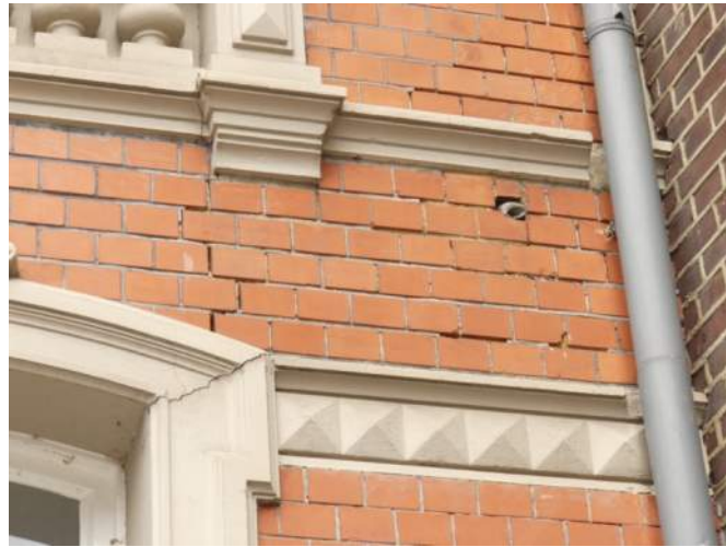
Afb. §22.05 scheuren en uitgespoeld voegwerk
