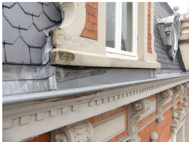
Afb. §33.87.13, loshangend èn ontbrekend lood
