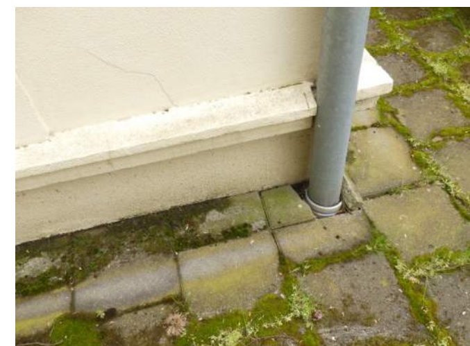
Afb. $50.22, verloop hwa door waterlijsten en 'open' aansluiting grondriool
