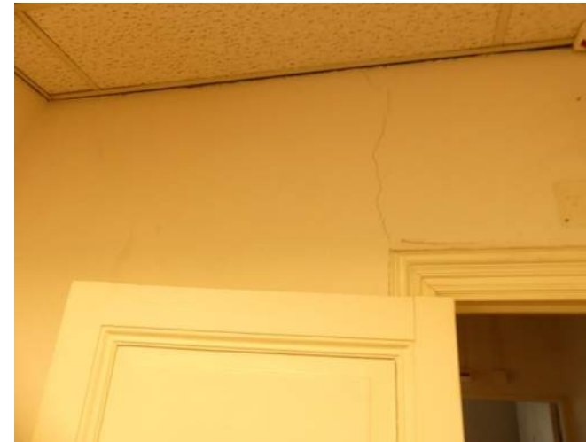
Afb. §40.43, gescheurd stucwerk boven deurkozijn
