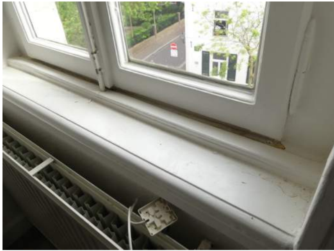
Afb. §30.23, binnenzijde draairamen, vuil condensgootje
