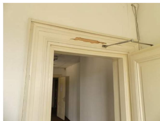
Afb. §46.21.45, afgefallen verf binnendeurkozijn
