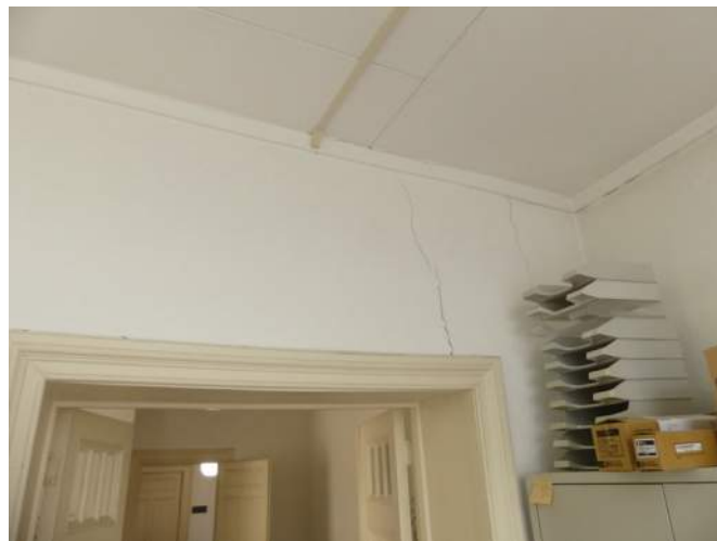
Afb. §40.40, gescheurd stucwerk boven deuropening
