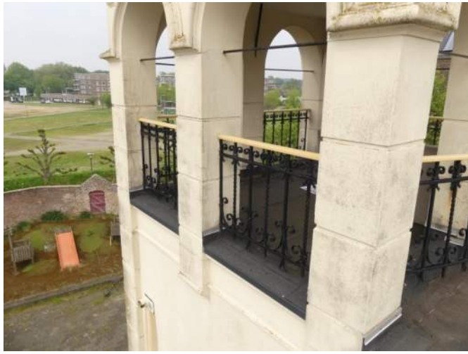
Afb. §46.23.13, vervuilde verf achtergevel, toren
