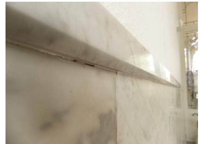
Afb. §35.46, uitvallend voegwerk
