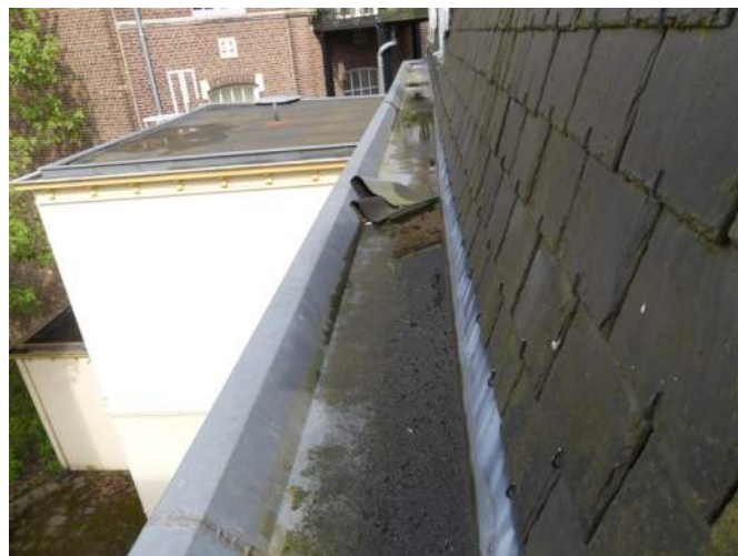
Afb. $50.13, bakgoot achter, vervuild met gruis (afschot?) en bouwafval
