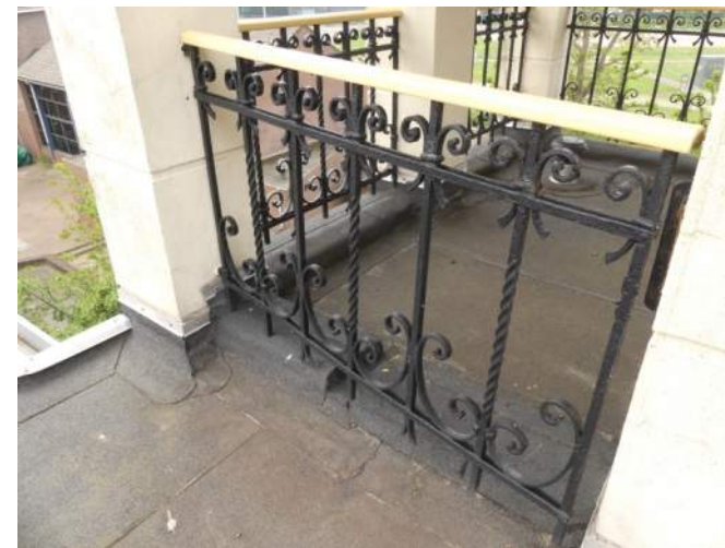
Afb. §43.07, slecht sluitend poortje en roestvorming op de hele balustrade van de toren galerij
