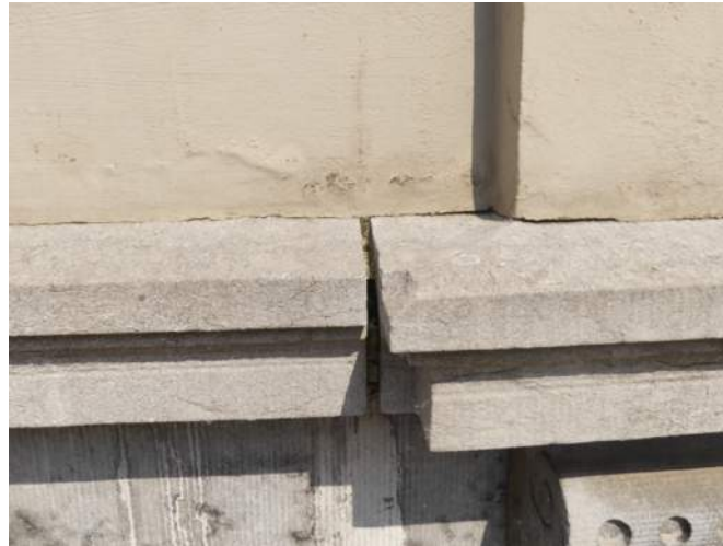
Afb. §35.02, uitgespoeld voegwerk, afgebroken stukje
