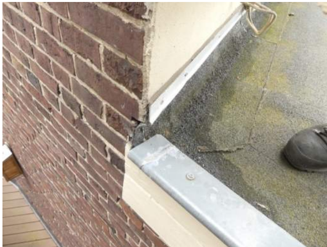
Afb. §33.33.03, niet waterdichte aansluiting
