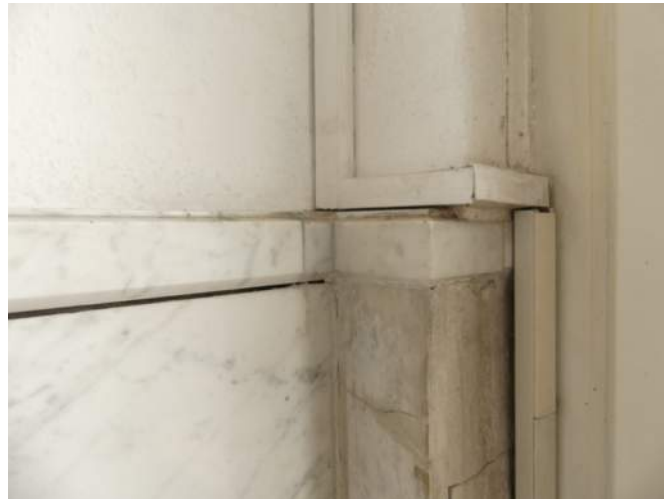
Afb. §35.52, uitgevallen voegwerk lambriseringslijst
