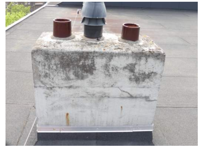
Afb. §22.20 gescheurde schoorsteenkop
