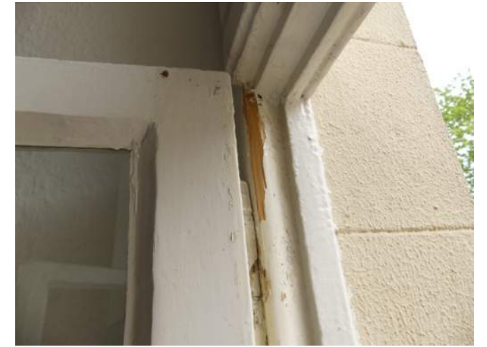
Afb. §46.21.32, dagkanten kozijnen en ramen zijn zeer slecht of geheel niet behandeld, hier ontbreekt een stuk en is een andere kleur zichtbaar
