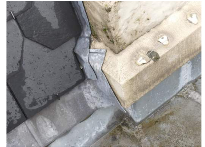
Afb. §33.87.10, slecht uitgevoerde aansluiting
