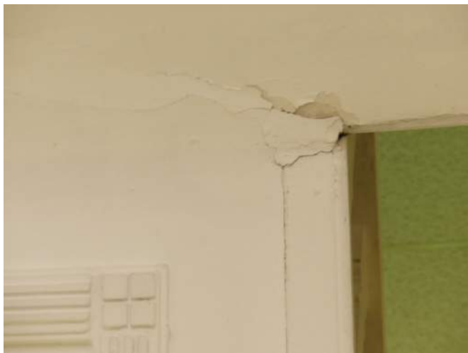
Afb. §40.39, losgescheurd stucwerk
