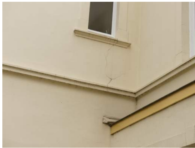
Afb. §22.14 scheuren achtergevel
