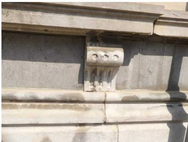
Afb. §35.05, uitgespoeld voegwerk (zetting?), gescheurde console
