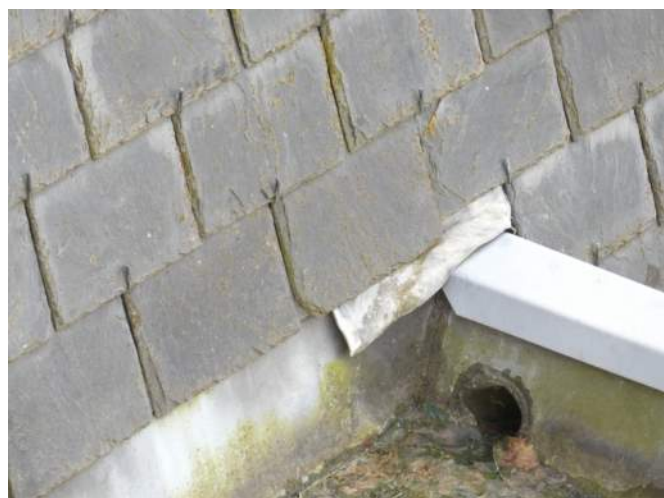
Afb. §33.51.29, uitzakkende dan wel ontbrekende koperen leihaken, slechte aansluiting zinken afdekkap
