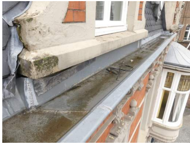
Afb. §50.04, verkeerd afschot linkse goot, water in goot verdampt na verloop van tijd, maar is funest voor de levensduur van het zink
