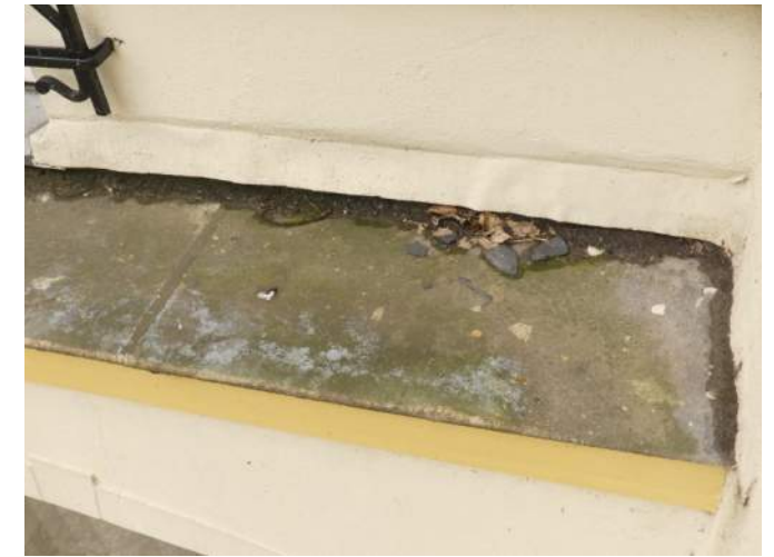
Afb. §33.87.32, te lange strook muurlood
