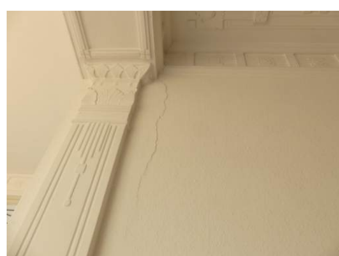
Afb. §22.23 gescheurde binnenmuren
