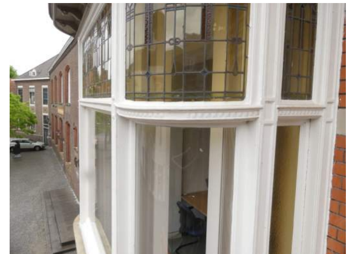
Afb. §30.20, verzakt kalf ronding erkerkozijn
