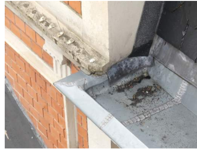
Afb. §50.07, onvoldoende uitgevoerd einddetail
