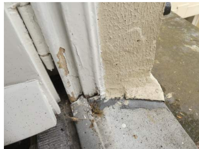
Afb. §46.21.43, beschadigde verf, frans balkonkozijn verdieping
