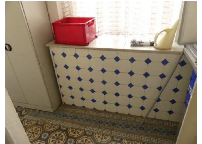
Afb. §41.10, versleten voegwerk vensterbank
