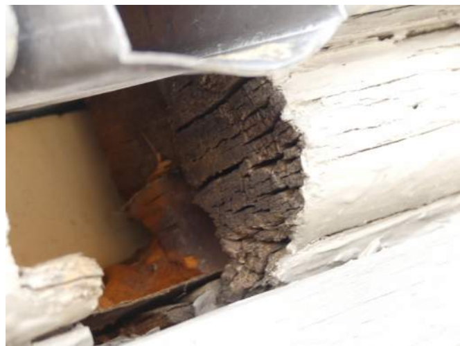
Afb. 37: onder waterafvoer zichtbare oude en nieuwe isolatie, elke vorm van afdichting ontbreekt
