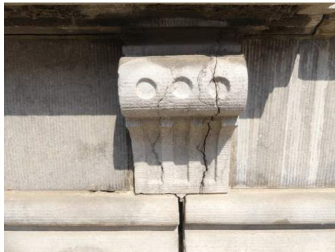
Afb. §35.04, gescheurde console
