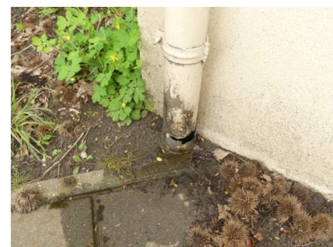
Afb. $50.24, beschadigde hwa
