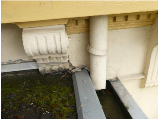
Afb. §33.33.01, slecht uitgevoerde aansluiting, schroeven door monumentale console
