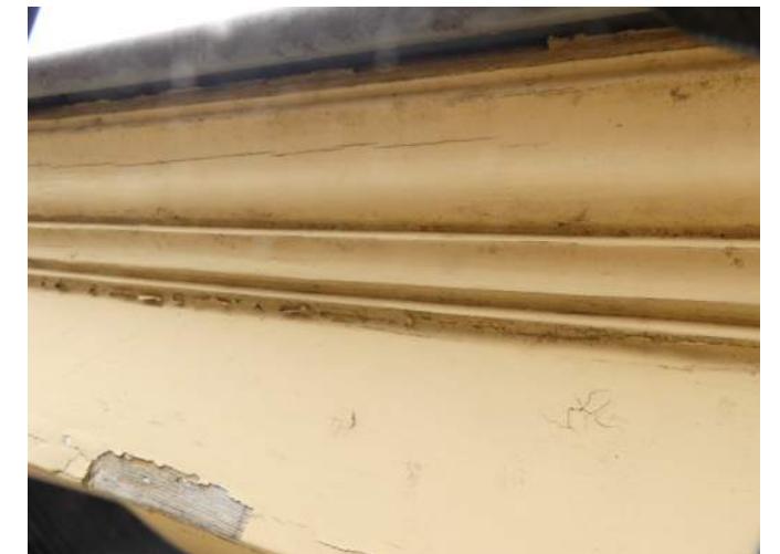
Afb. §24.20, gebarsten neuslijst bakgoot toren
