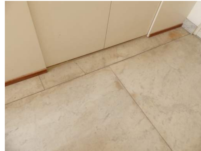
Afb. §35.57, gebroken vloerplaat
