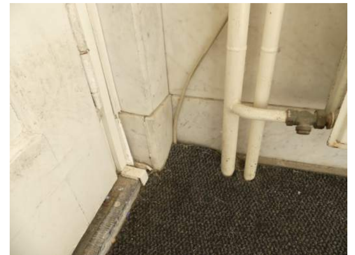
Afb. §35.48, uitgevallen voegwerk plintlijst
