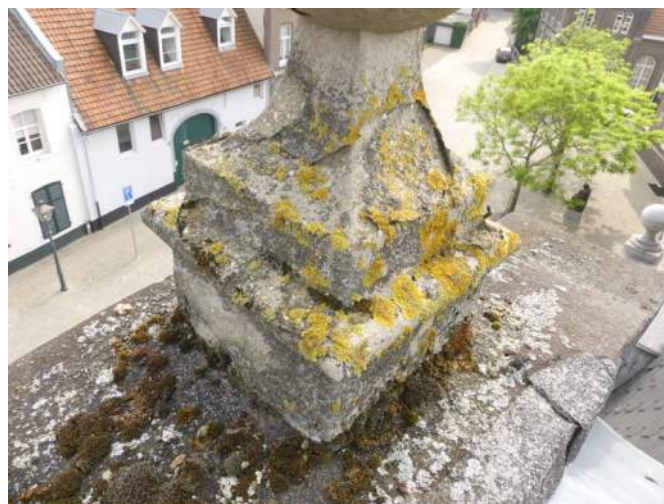
Afb. §35.28, degraderende pinakelschacht
