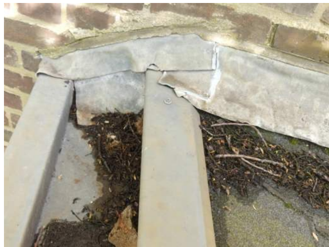
Afb. §33.33.06, zeer slordig uitgevoerde ophoging van het plat dak: lood hangt in goot en op dak, zonder felsrand bij overlap, capillaire werking
