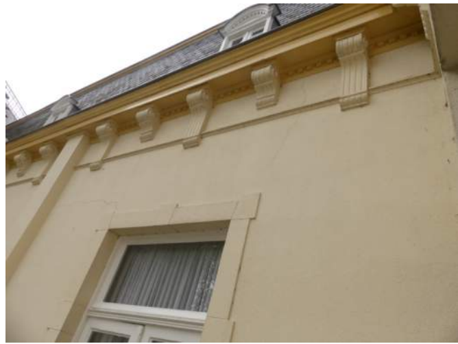
Afb. §22.13 scheuren achtergevel
