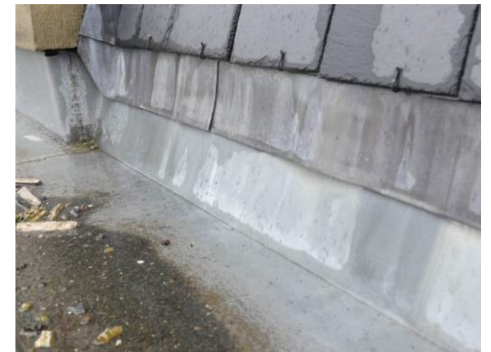
Afb. §33.51.08, te hoog aangebrachte voetlei
