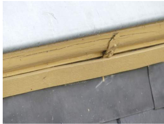
Afb. §24.04 verkeerd uitgevoerd detail
