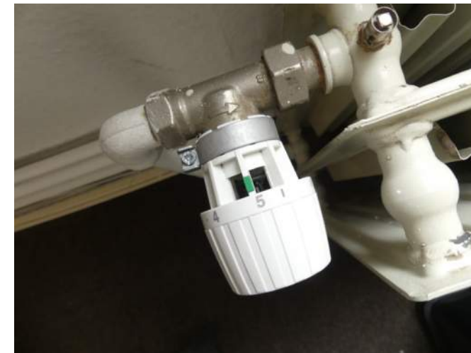
Afb. §60.03, aangetroffen stand op thermostaatkraan op (zolder?)verdieping
