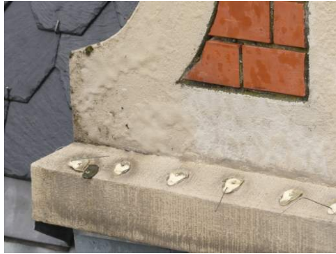
Afb. §46.23.02, onregelmatig dikke verflaag
