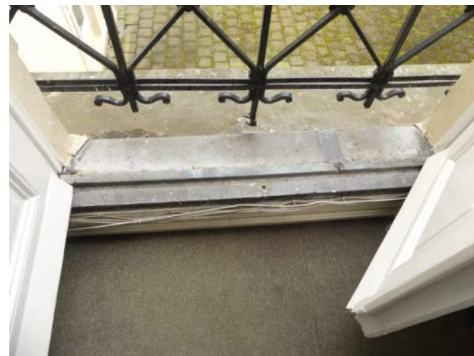
Afb. §35.33, onderdorpel (frans) balkondeuren, zonder afwatering: als er water of sneeuw in het gootje komt, kan het niet naar buiten afgevoerd worden
