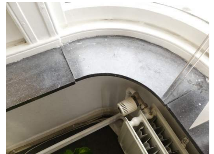
Afb. §35.36, uitgevallen voegwerk en losliggende/slecht gestelde vensterbank erker
