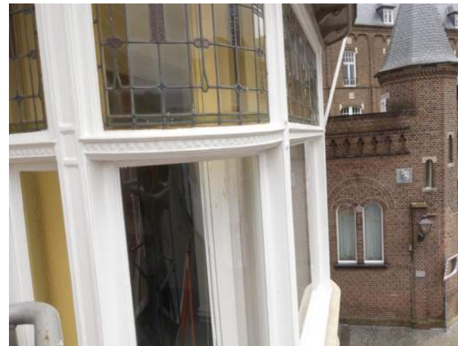
Afb. §30.19, verzakt kalf ronding erkerkozijn
