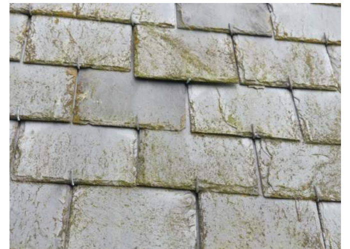
Afb. §33.51.22, weggevallen en uitgezakte leien, uitzakkende koperen leihaken
