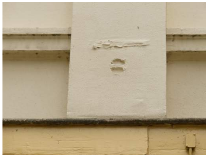
Afb. §46.23.18, dichtgeschilderd veegluik voormalige schoorsteen
