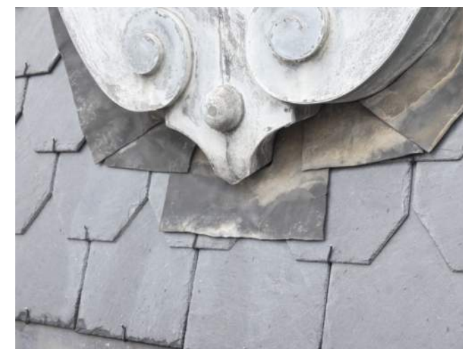
Afb §33.87.22, bestaand lood mogelijk herplaatst., zie niet aansluitend patroon?, onvoldoende overlap en ontbrekende felskantjes
