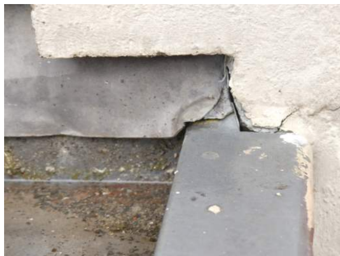
Afb. §50.06, slecht uitgevoerd einddetail; van de gevel af stromend water kan zonder weerstand de constructie in
