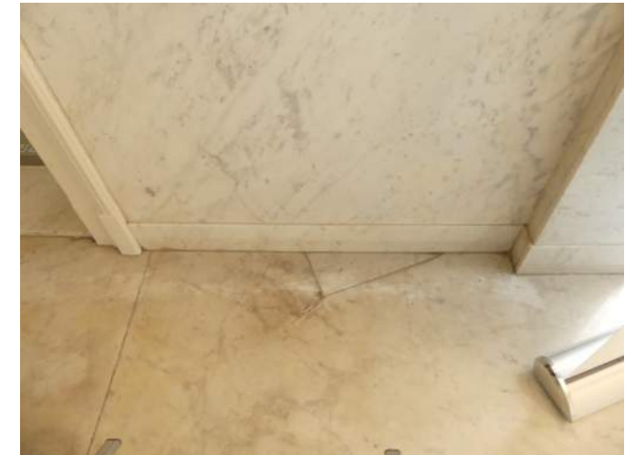
Afb. §35.58, gebroken vloerplaat
