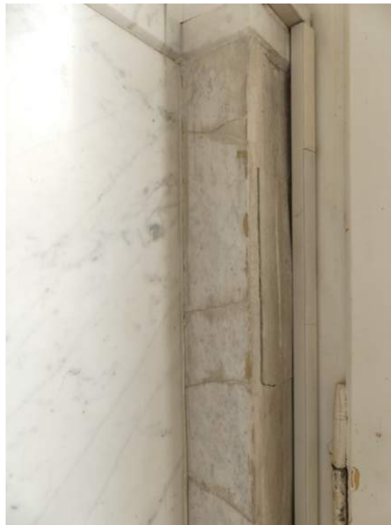
Afb. §35.54, ontbrekend paneel en gebroken paneel
