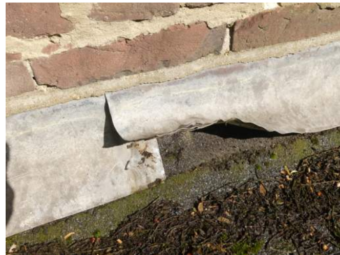
Afb. §33.87.28, onvoldoende overlap onder felskantje in oud lood boven vernieuwd plat dak
