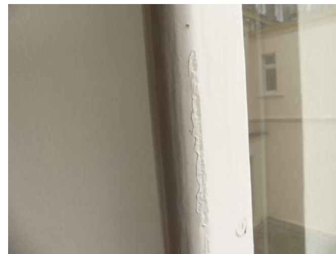
Afb. §46.21.35, afwijkende kleur op stolpstijl en losgetrokken verfrand, waarschijnlijk door het raam te sluiten terwijl de verf nog niet droog genoeg was
