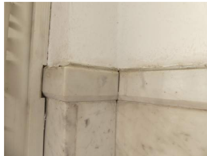
Afb. §35.47, uitgevallen voegwerk lambriseringslijst
