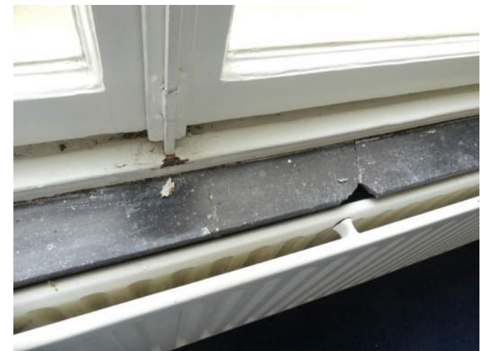
Afb. §35.34, beschadigde vensterbank
