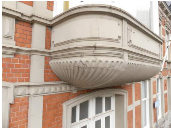
Afb. §40.25, scheuren in kuip en borstwering
