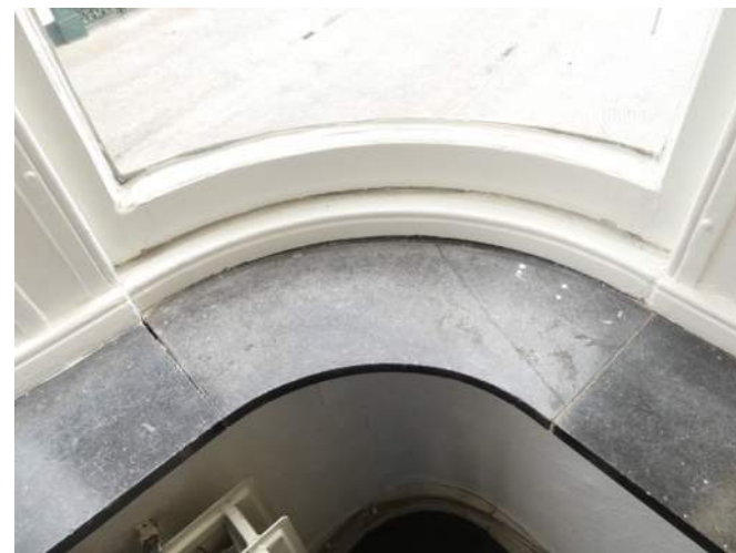
Afb. §35.35, uitgevallen voegwerk en scheur in vensterbank erker
