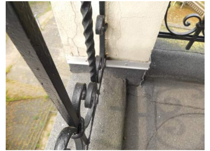
Afb. §40.20, scheuren in pleisterwerk galerijkolommen toren
