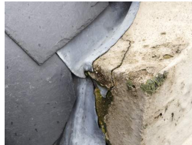
Afb. §33.87.11, slecht uitgevoerde aansluiting
