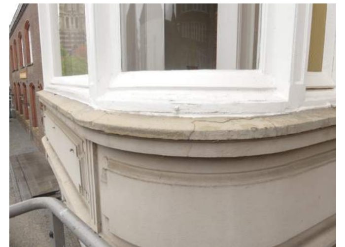
Afb. §40.34, scheuren in waterlijst borstwering
