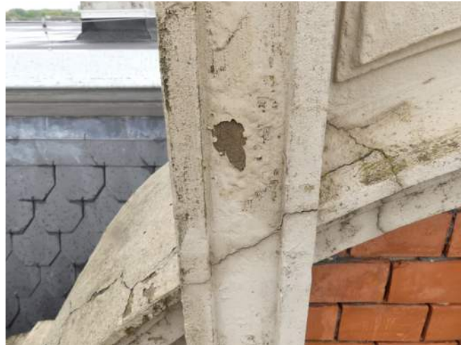
Afb. §35.14, scheuren in liggend en staand werk fronton-hals
