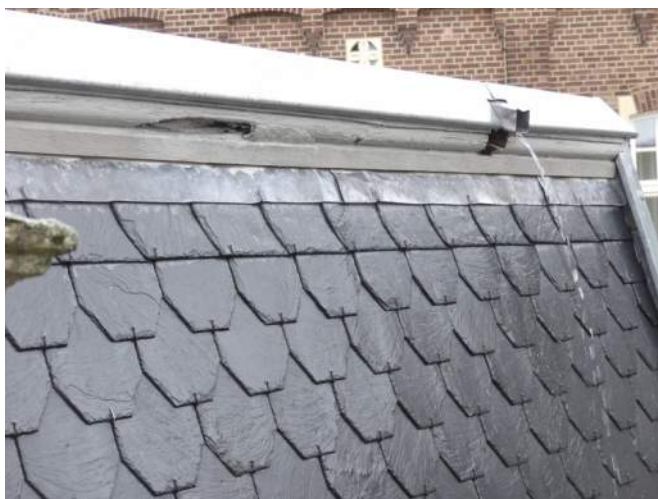
Afb. §33.51.05, spuwer verplaatst, daardoor meer harde belasting op leien vallend water
