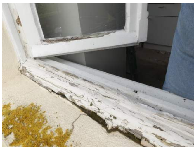
Afb. §46.21.39, volledig versleten verfwerk, loszettende stop-verfzomen bij enkel glas
