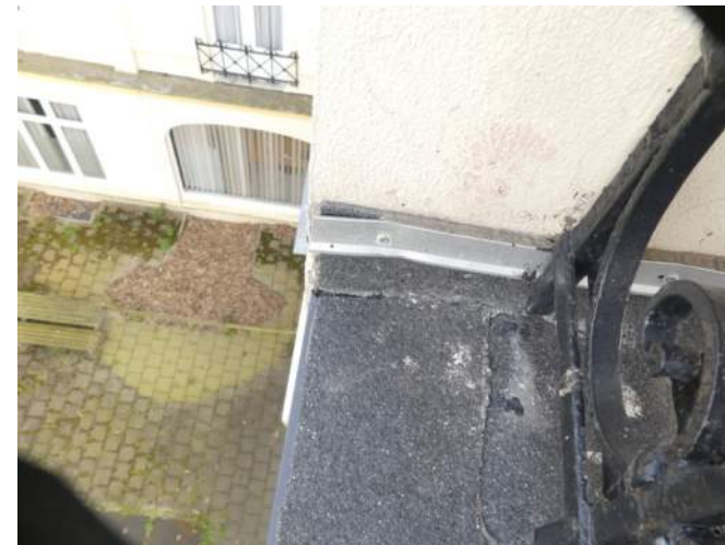
Afb. §33.33.09, onvoldoende dichtende aansluiting (niet aangesloten met randdetail en met kit afgedicht)
