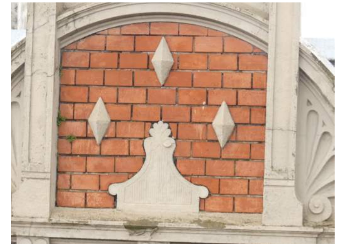
Afb. §22.08 uitgespoeld voegwerk halsgevel
