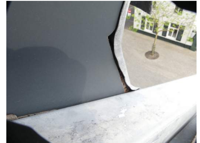
Afb. §24.10, verkeerd materiaal toegepast en verkeerde detailering
