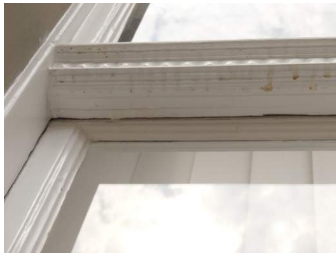
Afb. §30.14, beschadigde wissellat
