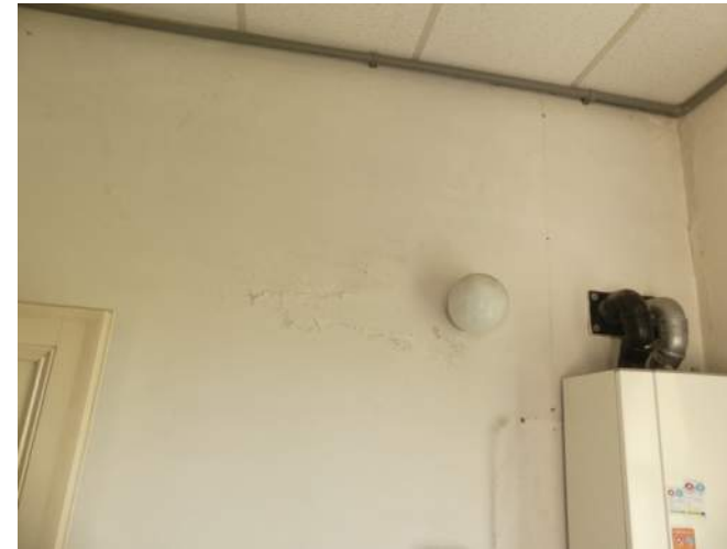
Afb. §40.41, gescheurd stucwerk tegen buitengevel toren
