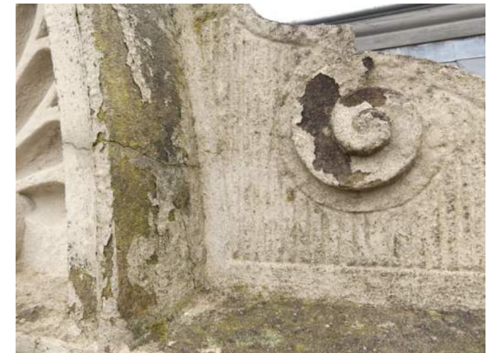
Afb. §35.22, scheuren in ornamentwerk
