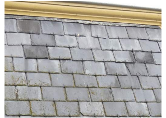
Afb. §33.51.20, weggevallen en uitgezakte leien, uitzakkende koperen leihaken
