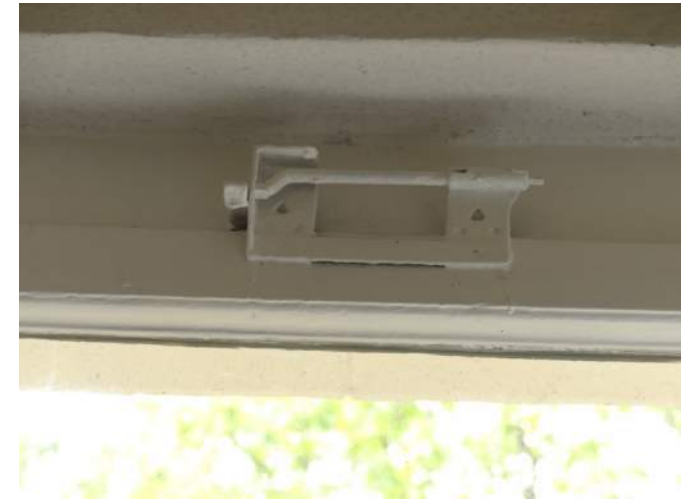
Afb. §30.18, ontbrekende bediening klepraam achtergevel
