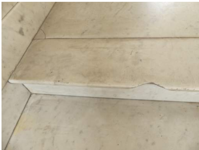
Afb. §35.41, beschadigde trede en afgebroken hoekje bordesplaat
