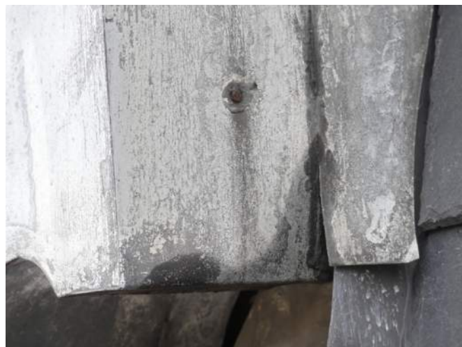
Afb. §33.87.36, gescheurde naad, nagel in het zicht
