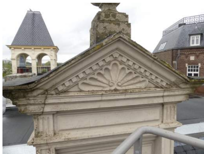
Afb. §35.15, scheuren in fronton, toepassing dakleer op kunststeen incorrect
