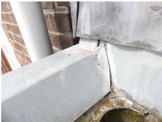
Afb. §50.05, slecht uitgevoerd einddetail; niet waterdicht en vuil verzamelend achter het schotje
