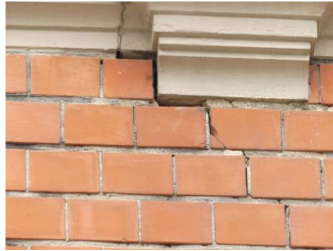
Afb. §22.04 scheuren tussen beletage en verdieping
