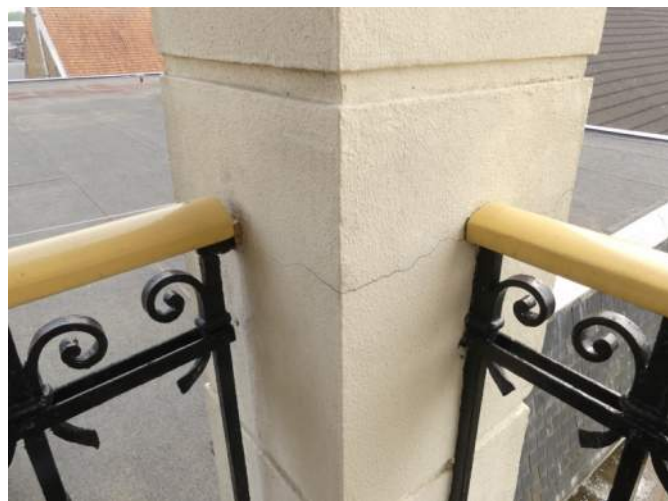
Afb. §22.17 scheuren achtergevel
