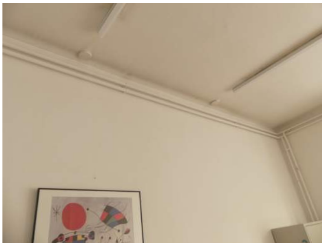
Afb. §40.51, roetaanslag tegen plafond (van verwarmingsleidingen)
