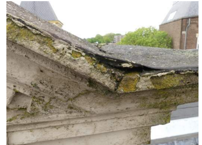
Afb. §35.20, openstaand dakleer
