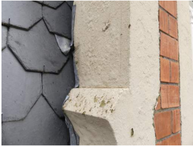
Afb. §46.23.01, onregelmatig oppervlak 'staande' verflaag, zakkers tijdens aanbrengen?
