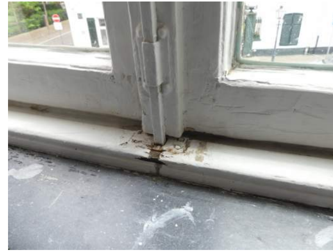
Afb. §46.21.31, beschadigde en gebarsten verf
