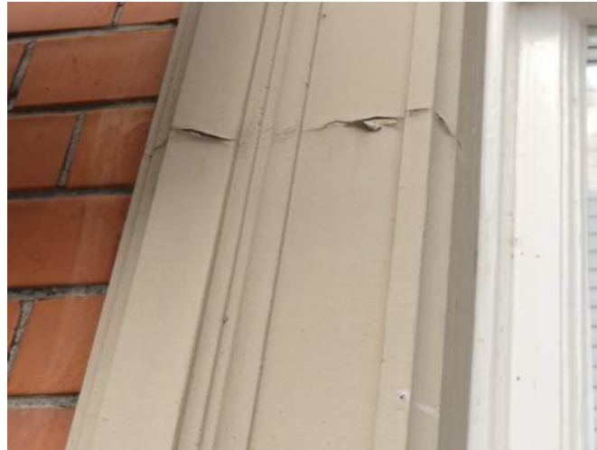
Afb. §46.23.06, gescheurde en 'zichzelf' afpellende verf
