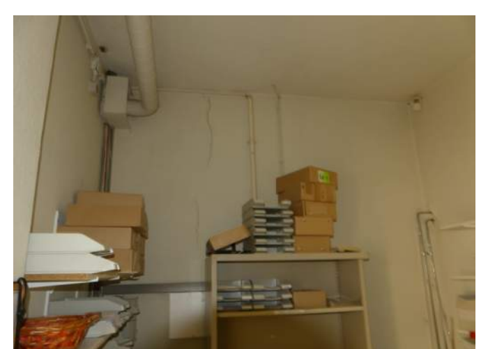
Afb. §22.24 gescheurde binnenmuren
