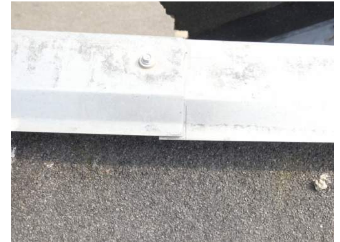
Afb. §33.87.52, te weinig overlap, geen felskant, geschroefd in liggend werk
