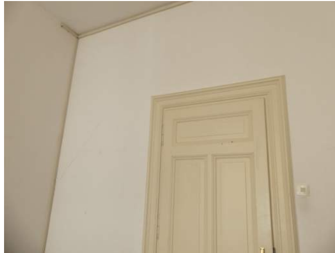
Afb. §40.36, scheur in stucwerk binnenwand beletage
