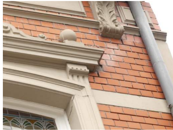
Afb. §22.06 scheuren en uitgespoeld voegwerk
