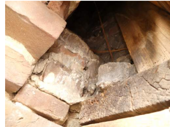
Afb. §24.09, ontbrekende afwerking
