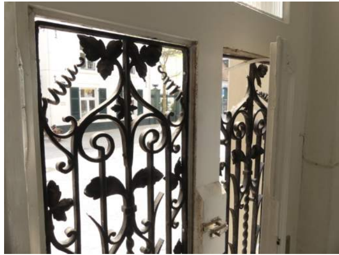
Afb. §30.12, raam kan niet open en losse/weggevalen tochtwering
