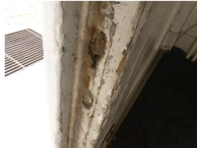
Afb. §30.07, disfunctionerend espagnoletsloot
