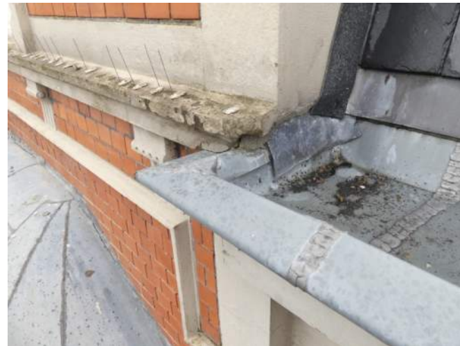
Afb. §40.06, door ondeskundig handelen loodgieter/dakdekker zeer slordig hersteld pleisterwerk
