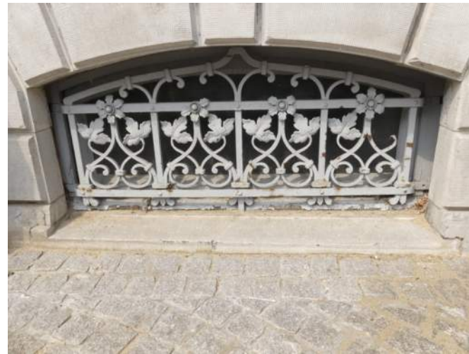
Afb. §43.04, smeedijzeren hekwerk souterrainvenster, ontbrekende bloemblaadjes (3.st.) en 1 drielobbig blad
