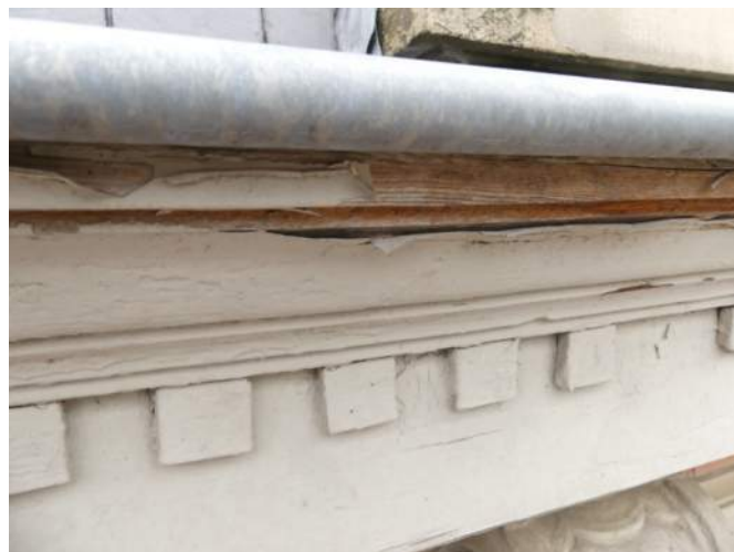
Afb. §46.21.05, afgebladderde, weggevalen verf, mogelijk is hier originele/oudere kleurlaag zichtbaar
