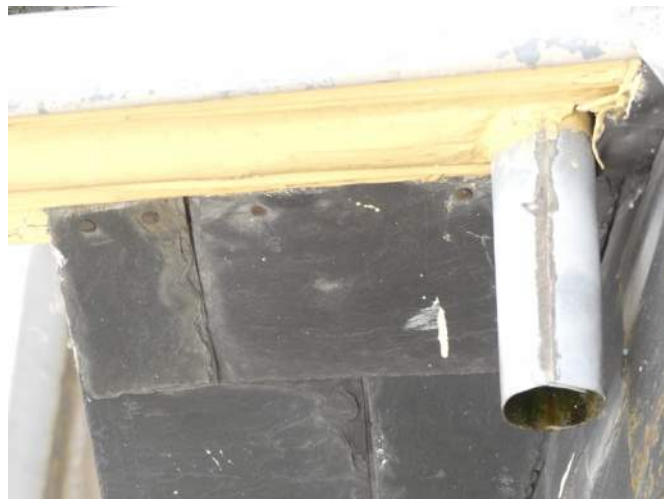
Afb. §33.51.25, nagels in het zicht (lood ontbreekt / te smal)
