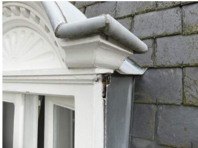
Afb. §33.87.46, openstaande aansluiting bekleding zijwang
