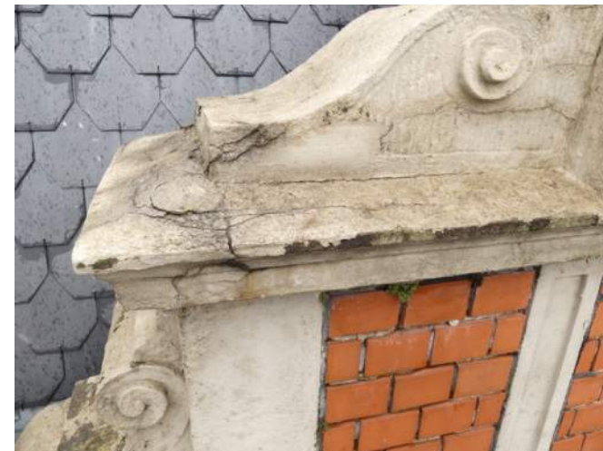
Afb. §35.21, scheuren in ornamentwerk
