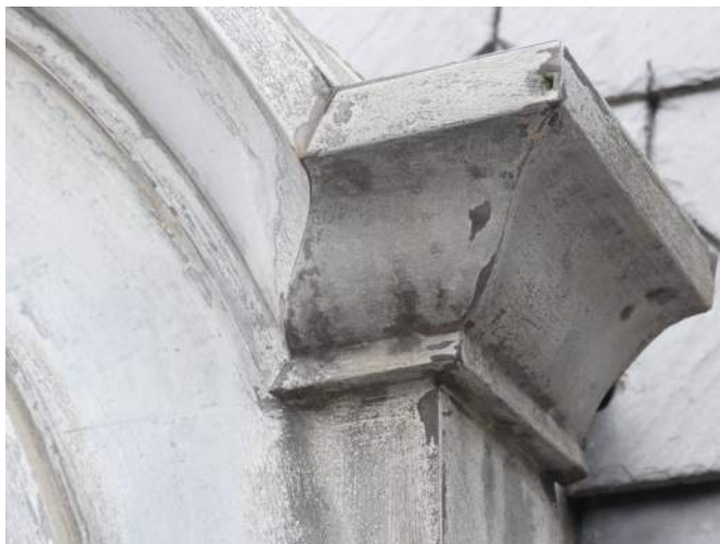
Afb. §33.87.35, beschadigd en verweerd zink
