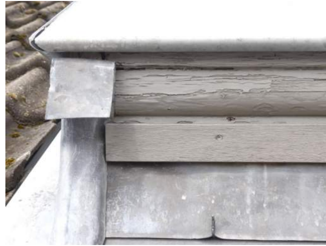
Afb §24.02 barsten in lijst, verkeerde schroeven en verkeerd hout
