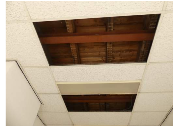
Afb. §40.56, sporen origineel stucplafond tegen balklaag
