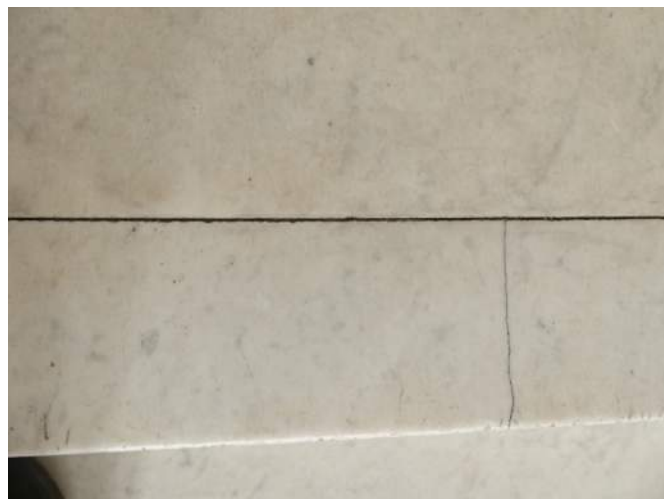
Afb. §35.42, gebroken trede
