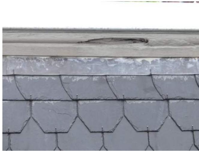
Afb. §24.03 niet hersteld gebrek profiellijst
