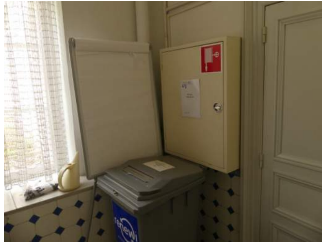
Afb. §54.01, container voor brandslanghaspelkast die achter een deur gepositioneerd is
