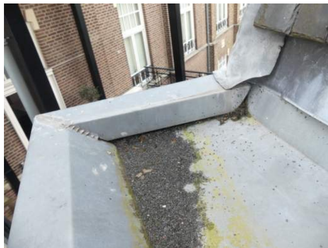
Afb. $50.14, slecht uitgevoerd einddetail; schotje hindert vrije loop van het water
