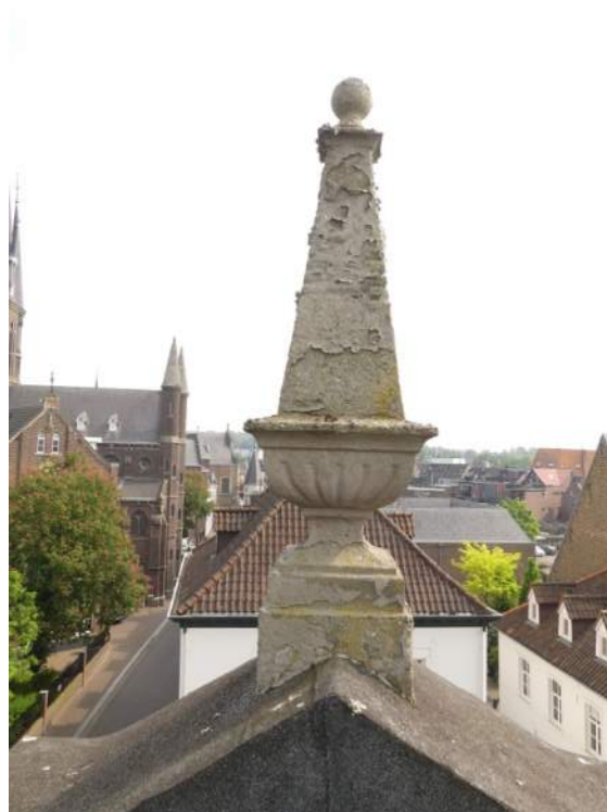
Afb. §35.18, beschadigde pinakelschacht, dakleer
