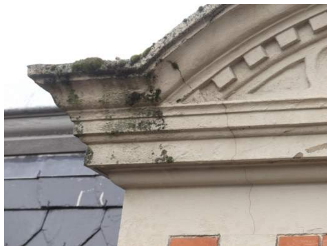
Afb. §35.29, gescheurde hoek
