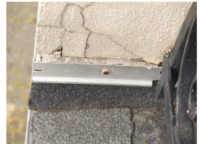
Afb. §33.33.08, onvoldoende dichtende aansluiting (niet aangesloten met randdetail en met kit afgedicht)
