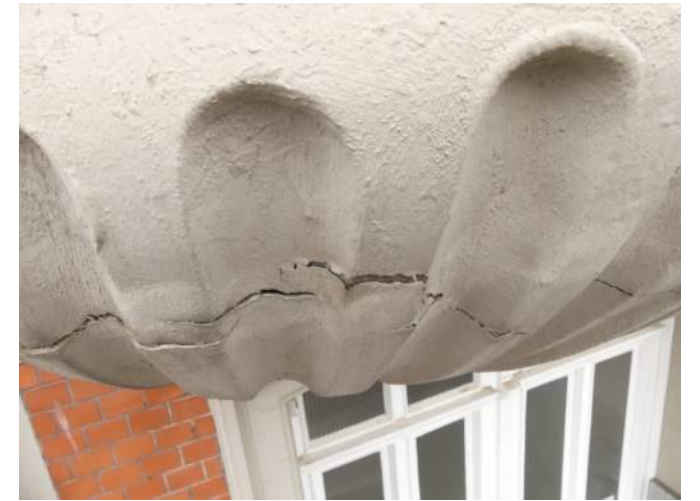
Afb. §40.32, onthecht verfwerk tpv scheuren
