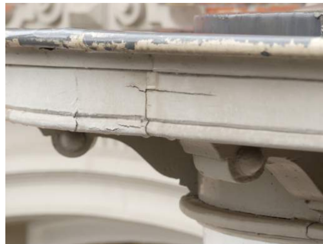
Afb. §24.14, openstaande verbindingen, gebarsten lijst
