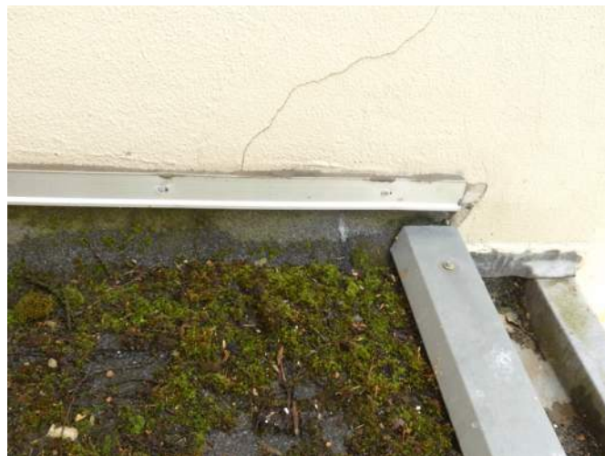
Afb. §33.33.04, knelstrip met kit is niet waterdicht en er ontbreekt een stuk dichting tussen knelstrip en afdeklijst
