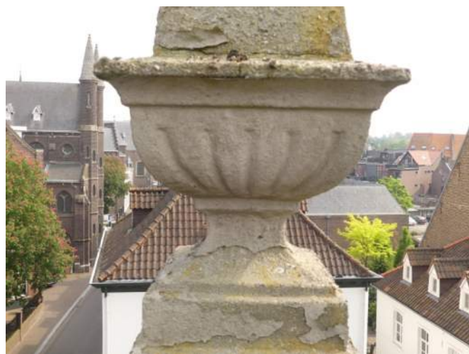
Afb. §35.16, scheuren in pinakelvoet
