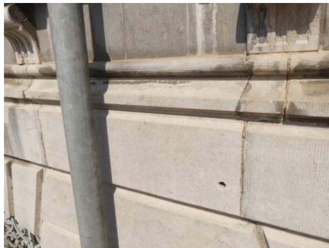
Afb. §35.06, uitgespoeld voegwerk (zetting?), gescheurde profiellijst en consoles
