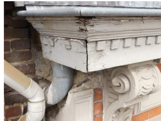
Afb. §46.21.07, afbladderende en verpoederende verf
