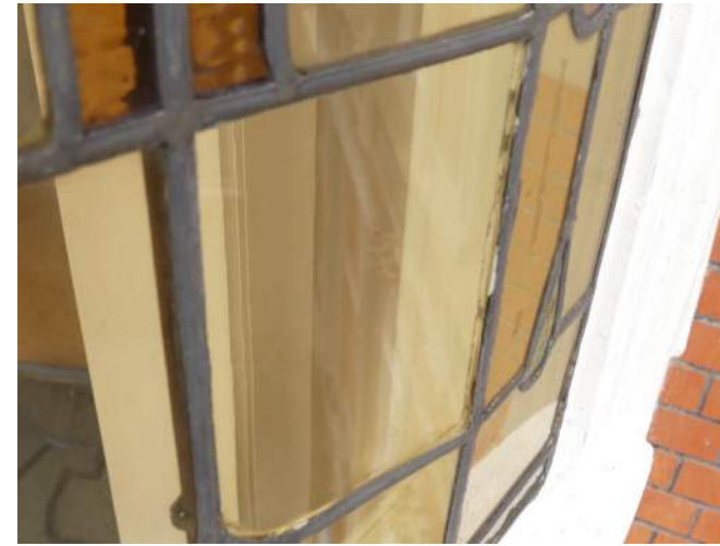
Afb. §34.25.07, gedeformeerd hoekpaneel met openstaand lood
