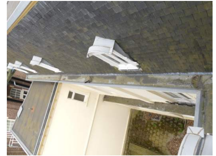
Afb. §33.87.50, bouwresten in de goot en versleten expansiestuk
