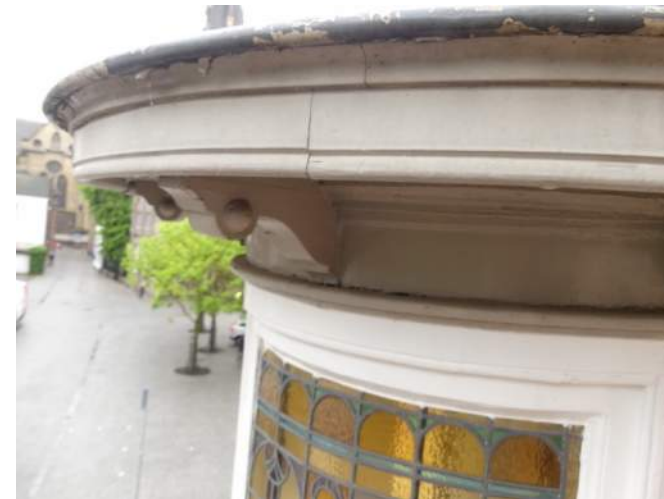
Afb. §46.21.09, gebarsten en afbladderende verf
