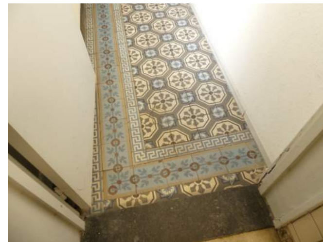
Afb. §41.11, gescheurde en gebroken tegels
