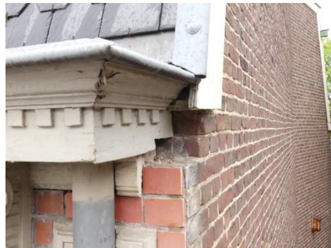
Afb. §24.06, openstaande verbinding, slordige aansluiting
