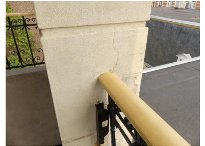
Afb. §40.22, scheuren in pleisterwerk galerijkolommen toren
