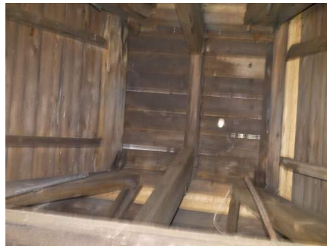
Afb. §24.16, onduidelijke situatie dakvloer (nader onderzoek)
