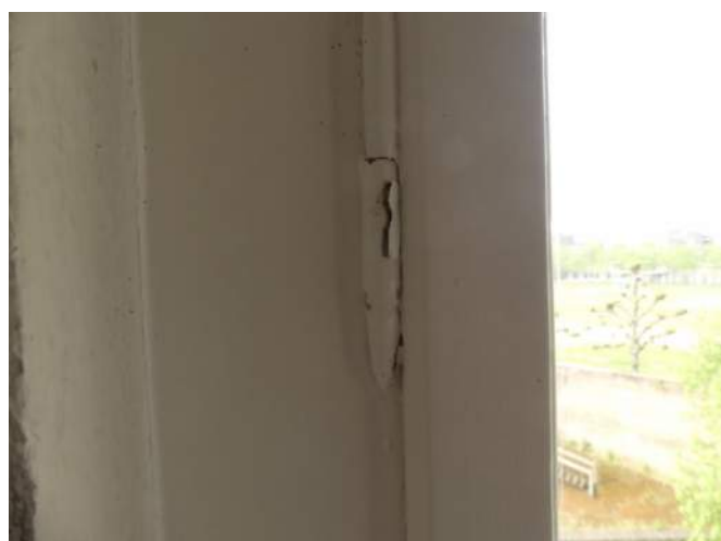
Afb. §46.21.42, van het scharnier gebarsten verf
