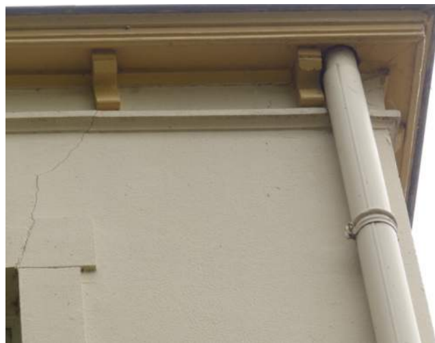
Afb. §22.16 scheuren achtergevel
