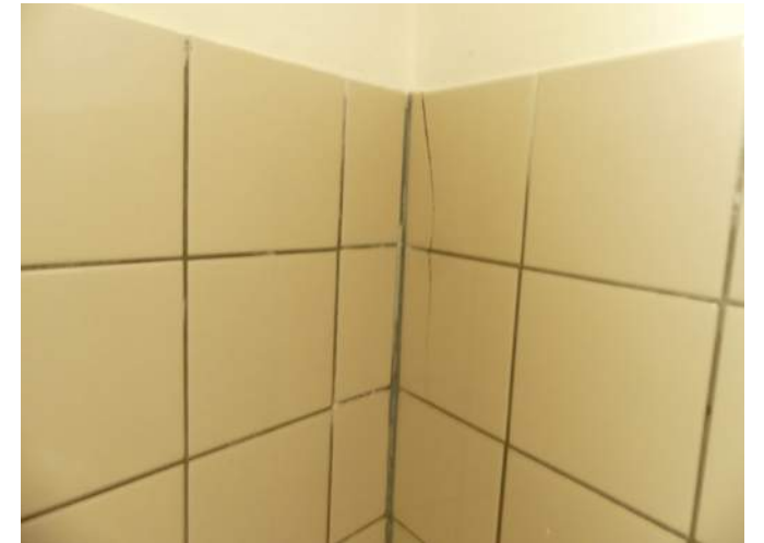
Afb. §41.08, gescheurde tegels in hoek
