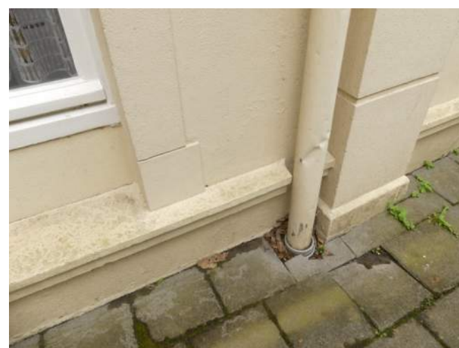
Afb. $50.23, verloop gedeukte hwa door waterlijst
