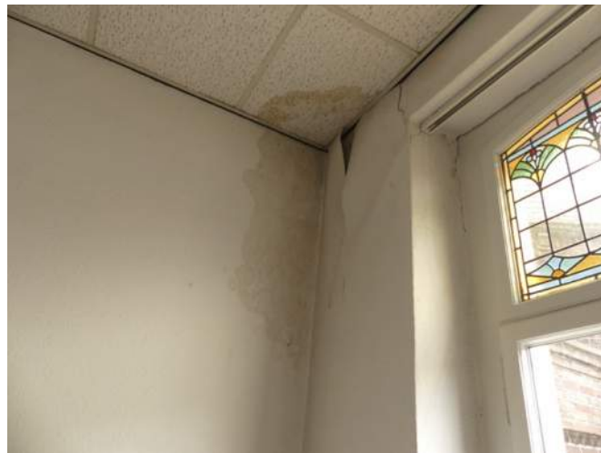
Afb. §40.38, door lekkage vochtbelast stucwerk
