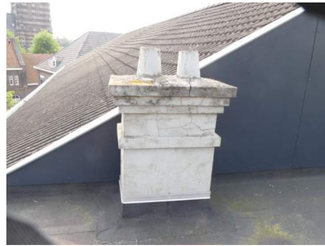
Afb. §22.19 gescheurde schoorsteenkop
