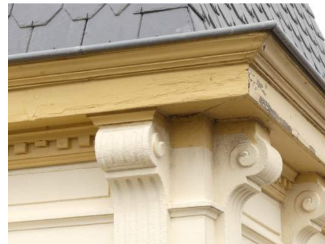
Afb. §46.21.11, gebarsten, onthechte (slecht geschuurde) verf NB: ontbrekend profiellijst en -latten
