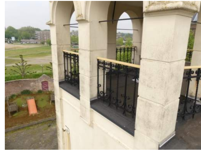
Afb. §40.21, scheuren in pleisterwerk galerijkolommen toren
