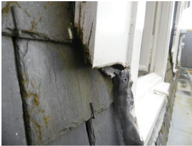
Afb. §33.87.25, onvoldoende sluitend, in het zicht genageld indeklod
