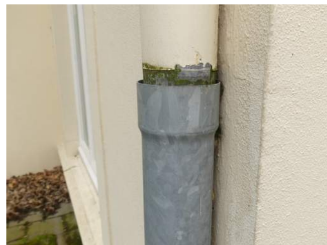
Afb. $50.21, openstaande aansluiting
