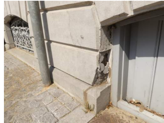
Afb. §35.07, afgebroken en slecht herstelde dagkant toegang souterrain
