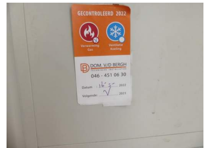
Afb. §60.02, keuringssticker cv-ketel
