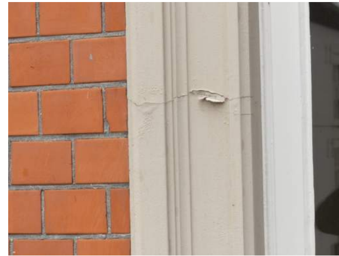
Afb. §46.23.07, gescheurde en 'zichzelf' afpellende verf
