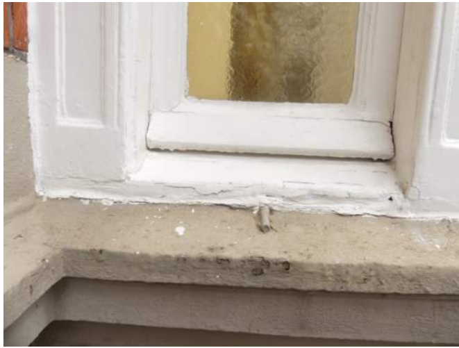
Afb. §46.21.25, gebarsten en onthechte verf, erker
