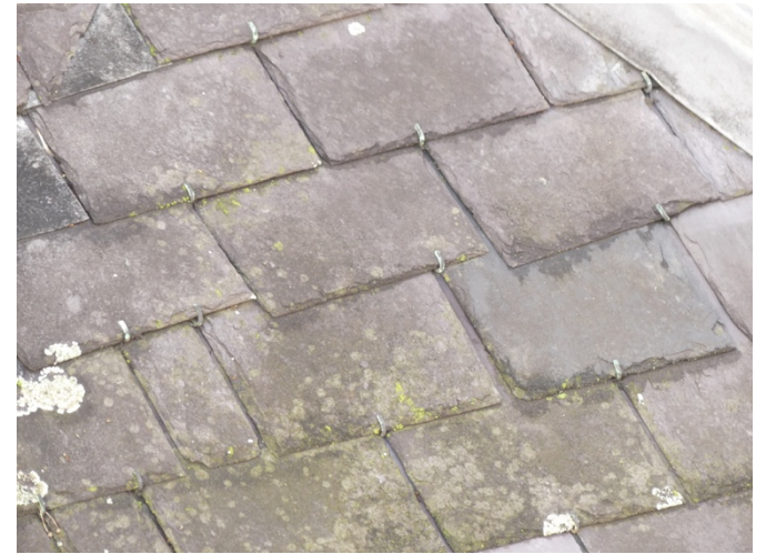
Afb. §33.12, kapotgebroken, scheefgezakte leien en foutieve reparatielei (afwijkende kleur), koperen leihaken
