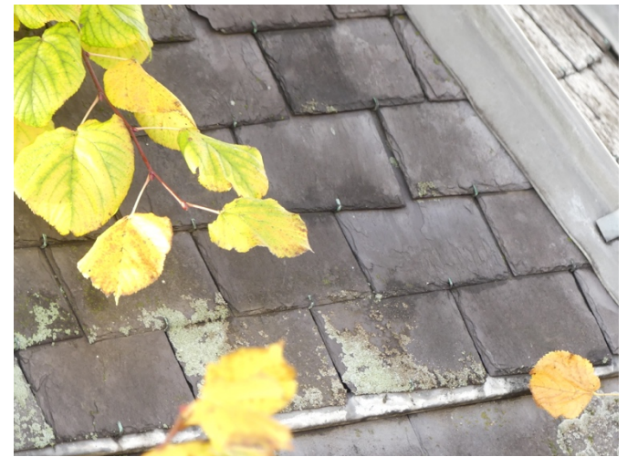
Afb. §33.10, beschadigde, scheefzakkende leien, koperen leihaken
