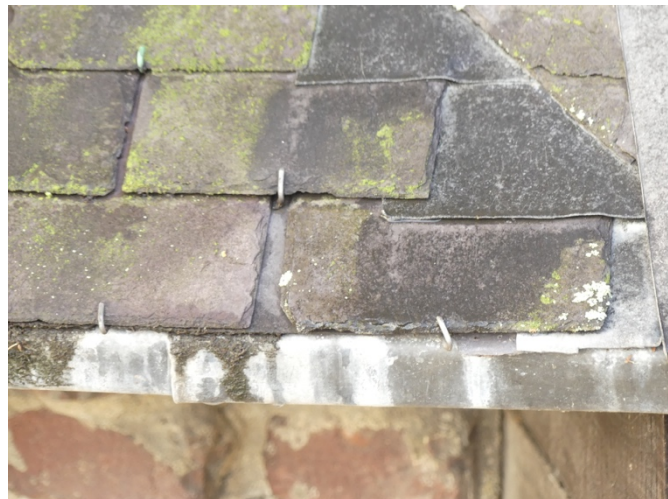
Afb. §33.08, te weinig overstek voetleien, slordig aangebrachte reparatieleien (rvs leihaken)
