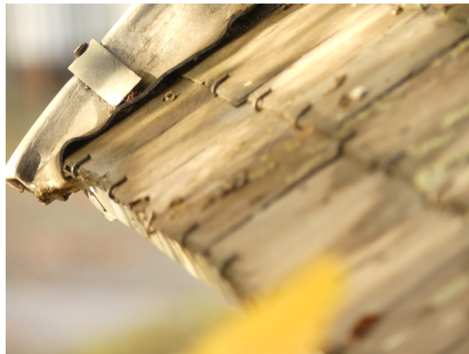
Afb. §33.18, openstaand keperlod – te licht gekozen of onvoldoende aangeklopt
