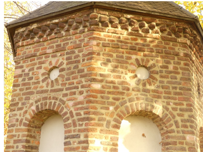
Afb. §22.01, gescheurd metselwerk in muurkroon
