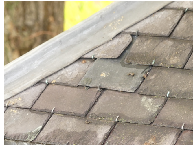
Afb. §33.09, te dikke (reparatie?-)lei, kantelende lei, koperen leihaken
