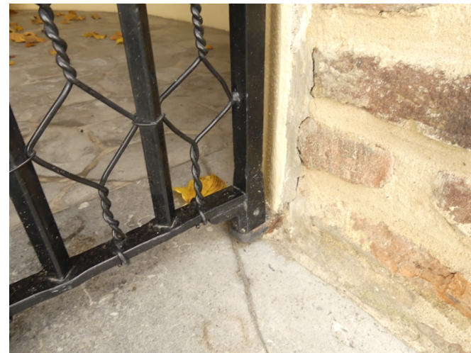
Afb. §22.03, losgekrompen en/of gescheurd voegwerk bij taats
