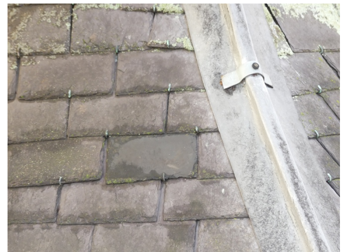
Afb. §33.14, foutieve (afwijkende groeve en kleur) reparatielei, koperen leihaken, deels genagelde leien
