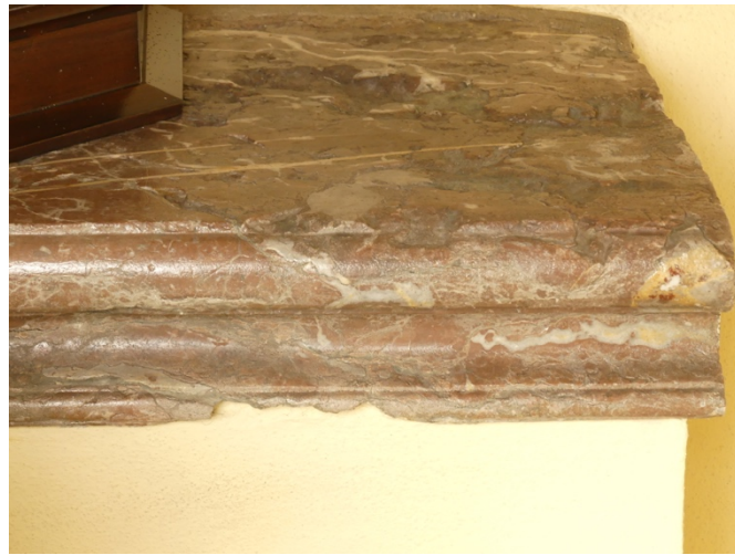
Afb. §35.04, afgebroken onderrand, barst in altaarblad
