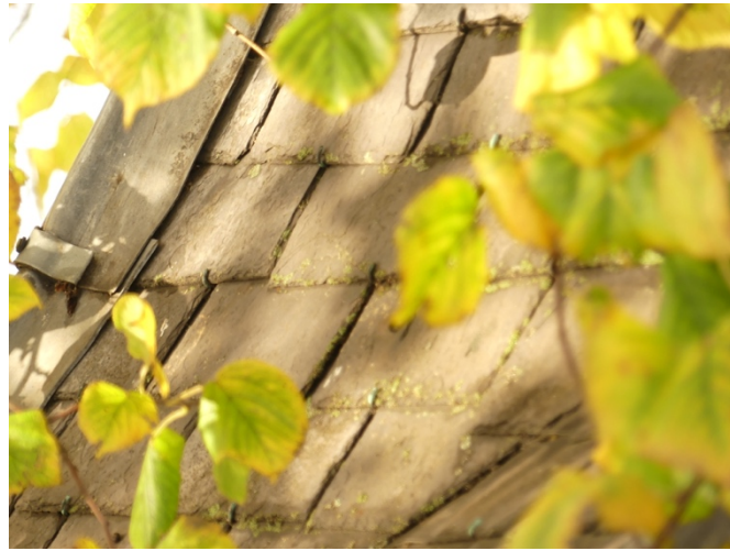
Afb. §33.16, scheef- en uitgezakte leien, openstaande koperen leihaken, onvoldoende overlap keperlod en ontbreken van felsrand aan onderste keperlod
