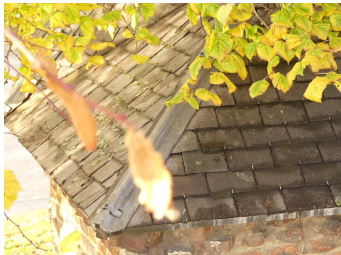
Afb. §33.06, openstaande koperen haken, reparaties met rvs haken, kantelende (pas-)leien
