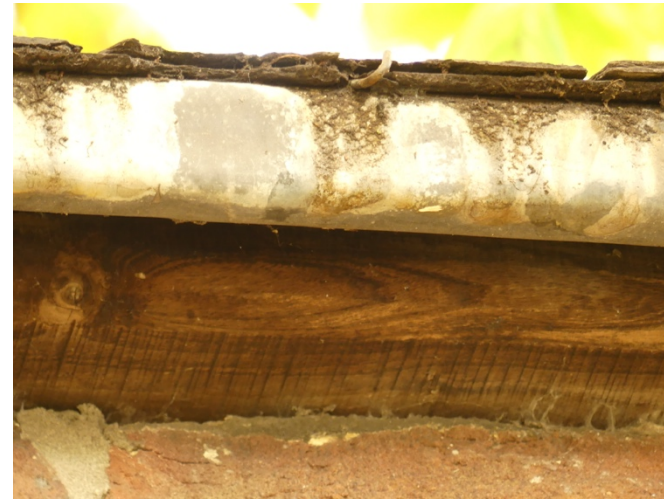
Afb. §33.21, onvoldoende voerstek bij (dun versleten) voetleien
