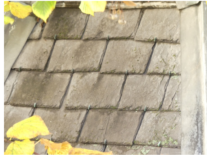
Afb. §33.11, gebroken, scheefzakkende, te ruim liggende leien
