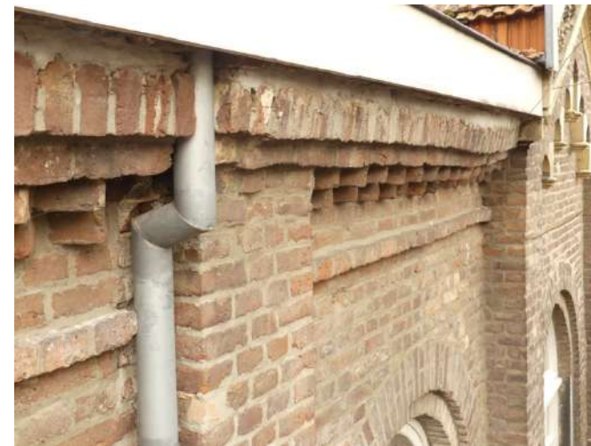
Afb. §46.21.03, schrale verf op (verkeerde) multiplex ondergrond
