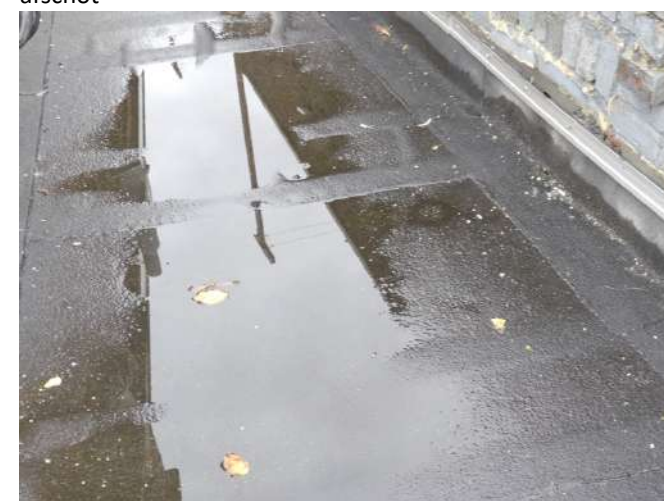
Afb. §33.33.06, plat dak op corridor niet op afschot en aansluiting met knelstrip
