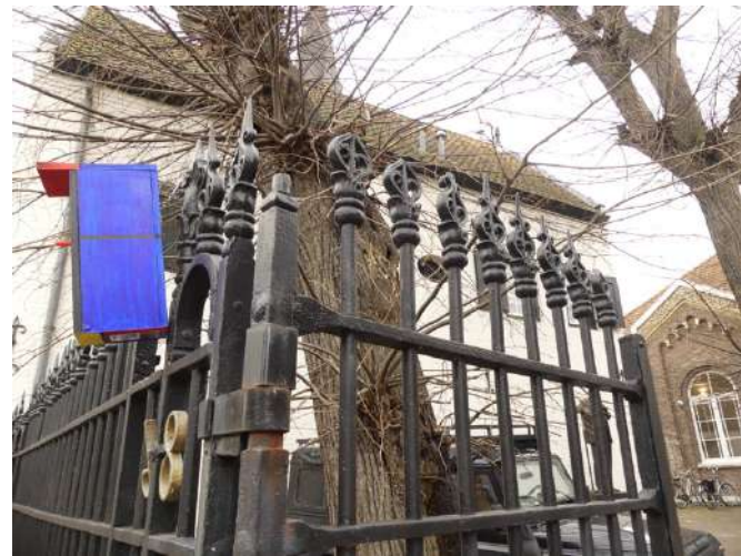
Afb. §43.08, ontbrekende hekwerkpunten
