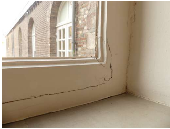
Afb. §30.26, van kozijndorpel losgebarsten inzetraam
