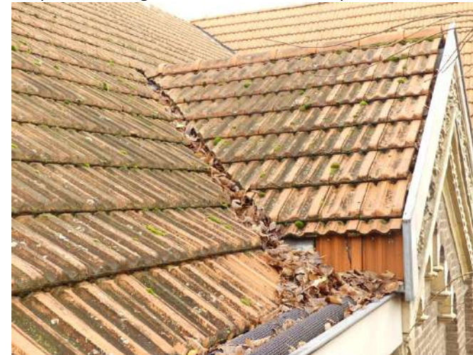
Afb. §33.41.05, te smalle kilgoot, deels dubbel bladgaas...zeer slecht uitgevoerd werk, aan beide zijden afgezaagde nokvorsten
