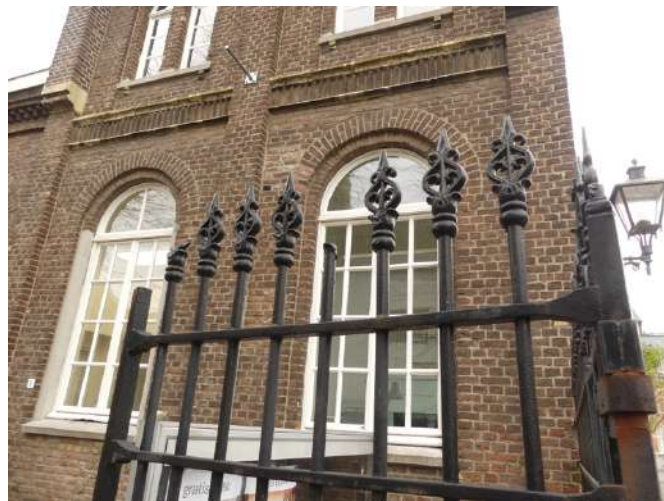
Afb. §43.09, ontbrekende hekwerkpunten en koppen
