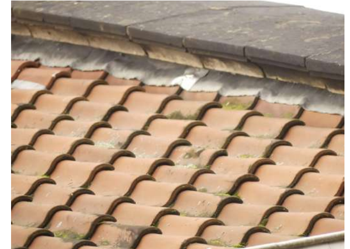
Afb. §33.87.04, scheurvorming in te lange loodstroken
