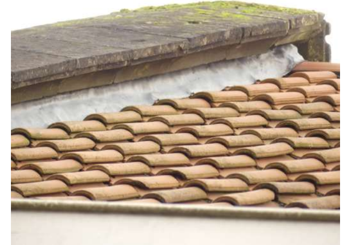
Afb. §33.87.02, beginnende scheurvorming door te lang lood, bij nok ondeskundig aangebracht
