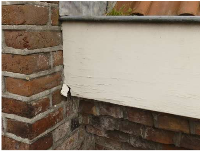
Afb. §46.21.07, aangetast hout bij kopse einde gootlijst, vermoedelijk geen of te schrale grondverf op kopse kant
