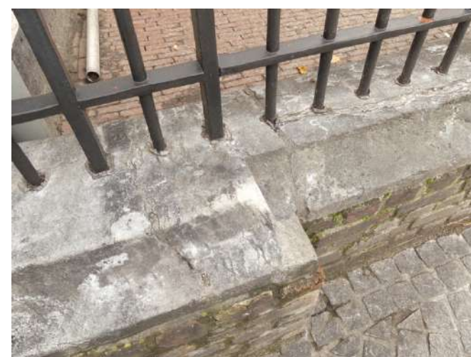
Afb. §35.25, brandlagen, scheuren en mortelreparaties
