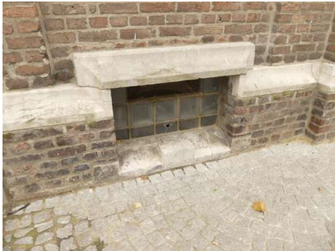
Afb. §35.43, scheuren en steken, brandlagen en mortelreparaties ontbrekende (weggenomen) middenstijl
