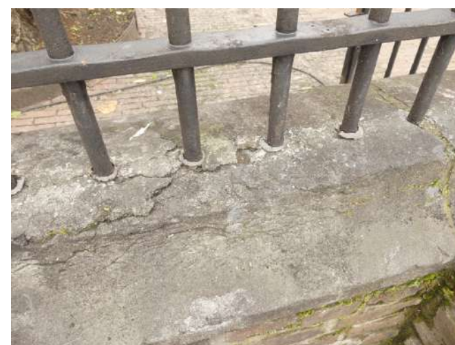
Afb. §35.27, brandlagen, scheuren en grote mortelreparaties
