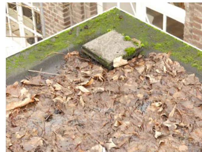
Afb. §33.33.02, niet goed functionerende, geblokkeerde afvoer
