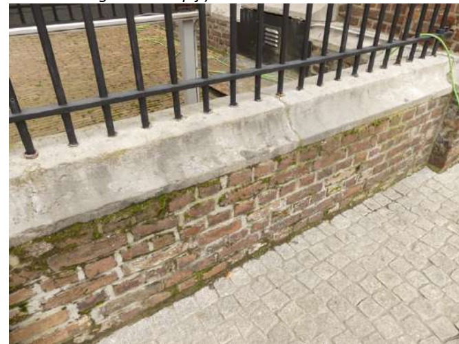
Afb. §35.37, brandlagen, scheuren en mortelreparaties
