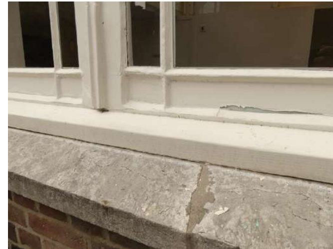
Afb. §46.21.17, loslatende verf van glasstrook
