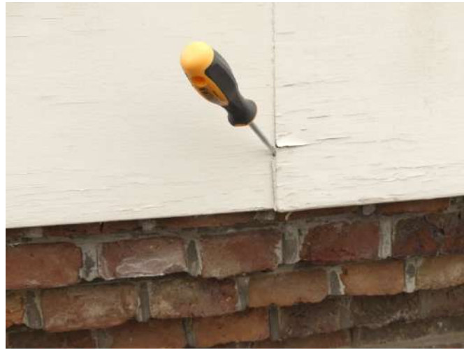
Afb. §46.21.08, aangetast hout bij rechte stuiknaden
