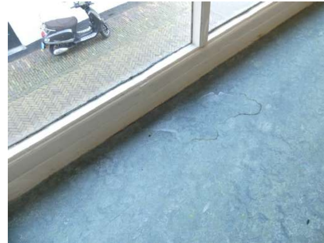
Afb. §30.35, condens- of lekkagewater op de tussenvloer
