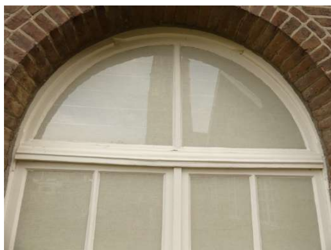
Afb. §30.40, onduidelijke situatie bovendorpel
