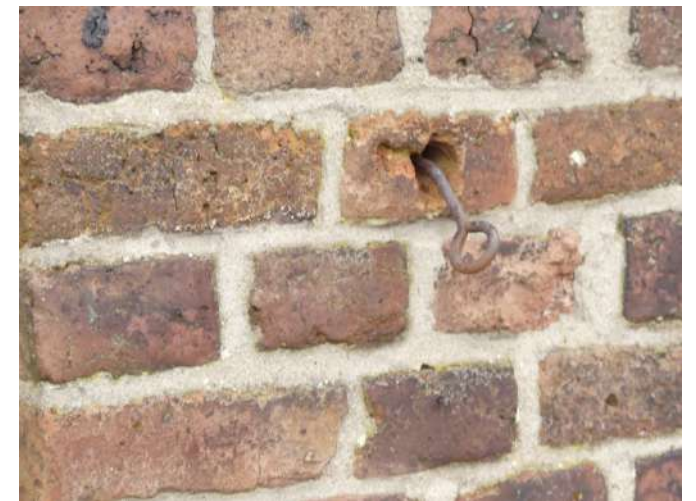
Afb. §22.08 schade door roestend ijzer
