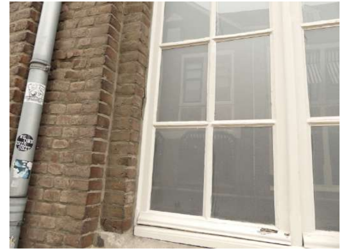
Afb. $46.21.28, gebarsten, loslatende verf
