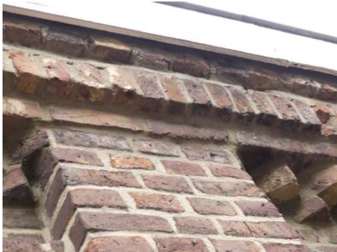
Afb. §46.21.11, schrale verf op (verkeerde) multiplex ondergrond
