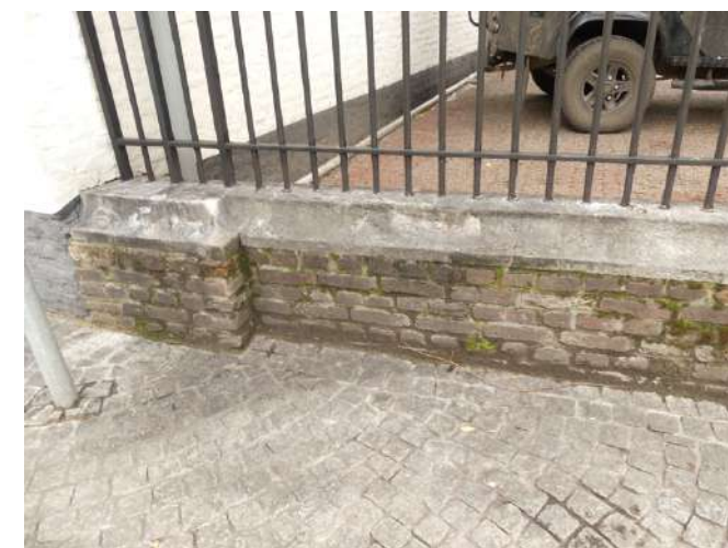
Afb. §35.24, brandlagen en minder goede mortelreparaties – historisch werk
