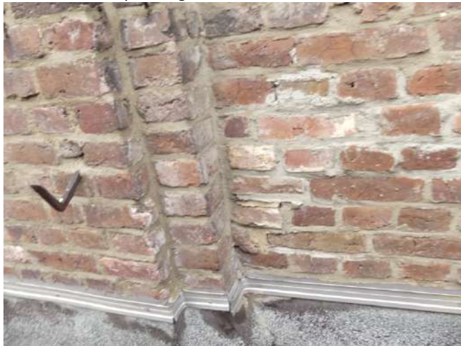
Afb. §33.33.11, knelstrip 'in/om de hoek gebogen' en kit op verschillende hoogtes....Is hier controle geweest?
