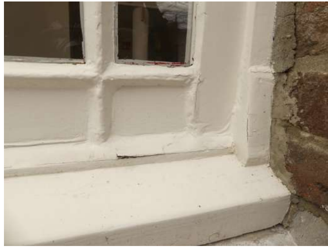
Afb. $46.21.20, barsten in verf, aan binnenzijde te ver op het glas geschilderd
