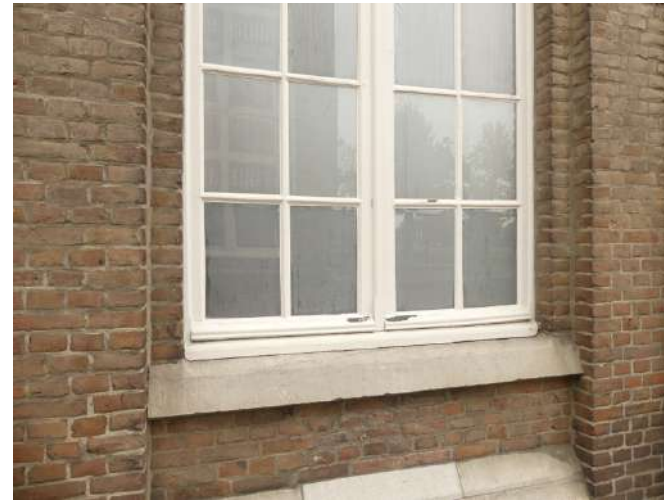
Afb. $46.21.29, gebarsten, loslatende verf van oud kozijn met oude ramen
