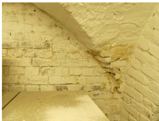
Afb. §22.27 slechte reparatie, vocht/zoutschade
