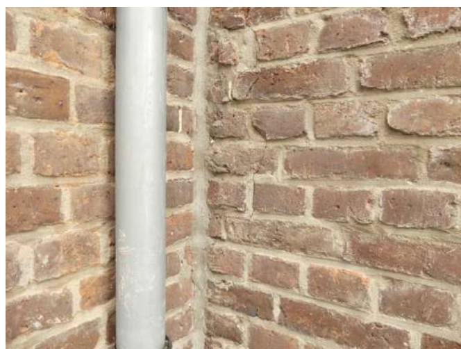
Afb. §22.13 gescheurd metselwerk
