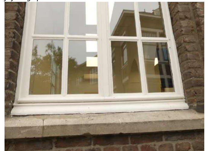
Afb. §35.52, breuk en mortelreparaties, vervuilde neuten
