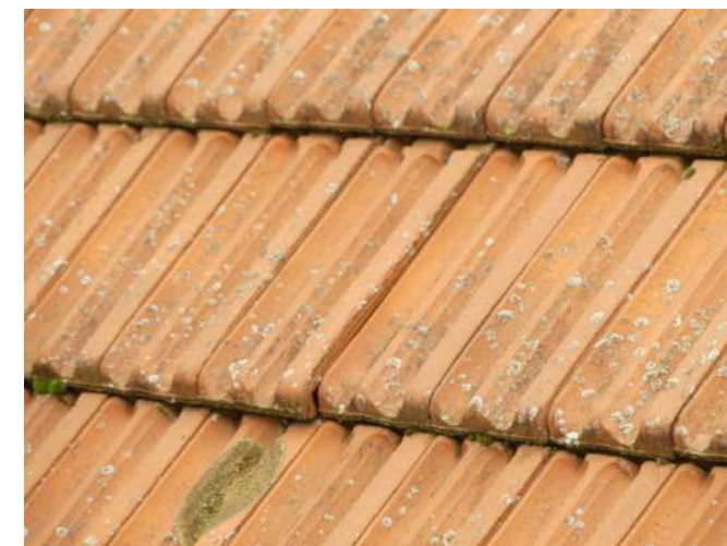
Afb. §33.41.14, een enkele iets verzakte dakpan
