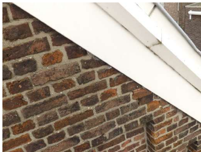
Afb. §22.12 gescheurd metselwerk gevelbeëindiging
