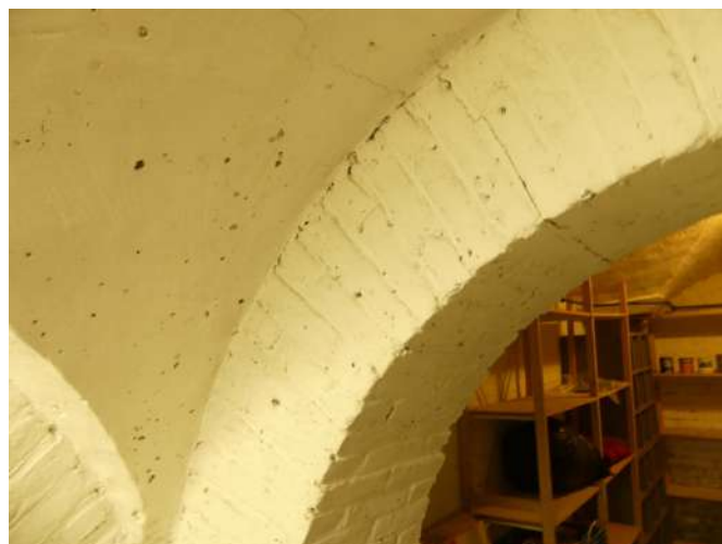
Afb. §22.24 dwarsgescheurde gewelfboog en zwikwerk
