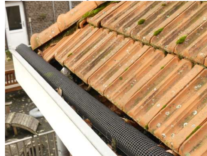
Afb. §33.41.03, disfunctionerend bladgaas en afgeschoven Dakpannen, mosgroei tussen vervuilde dakpannen
