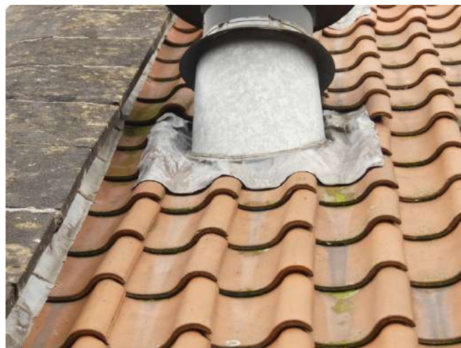
Afb. §33.87.08, slecht aangebrachte loodslabbe, rechts niet over de wel gedreven, kantelende, scheef liggende dakpannen
