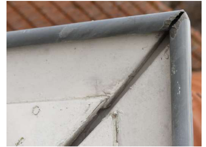
Afb. §46.21.14, barsten in te schrale verf, openstaande naden
