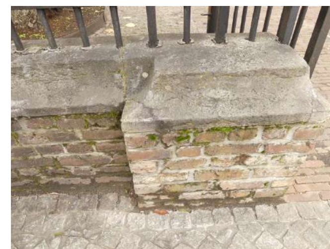
Afb. §35.28, brandlagen, scheuren en grote mortelreparaties
