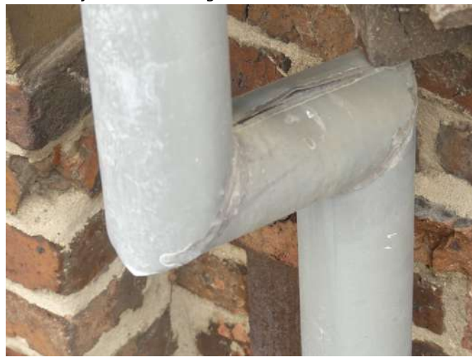
Afb. §33.87.20, gescheurde, openstaande soldeernaad in hwa
