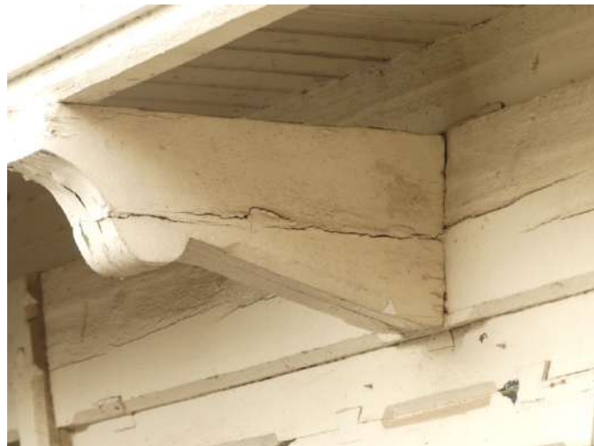
Afb. §24.11, openstaande verbindingen en gescheurd verfwerk
