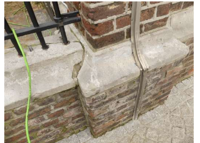
Afb. §35.38, scheuren en steken, brandlagen en reparatie
