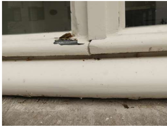
Afb. §30.04, aangetaste verbinding stolpraam rechterkozijn
