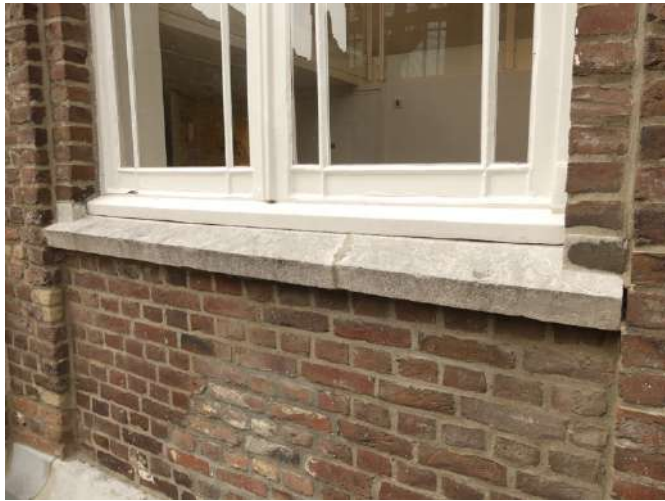
Afb. §35.57, brandlagen, steek en scheur (met reparatiesporen)
