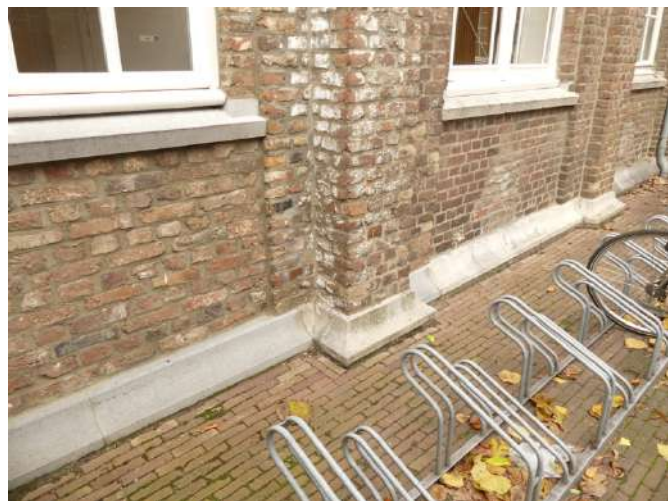
Afb. §35.34, brandlagen, scheuren en mortelreparaties in waterlijst
