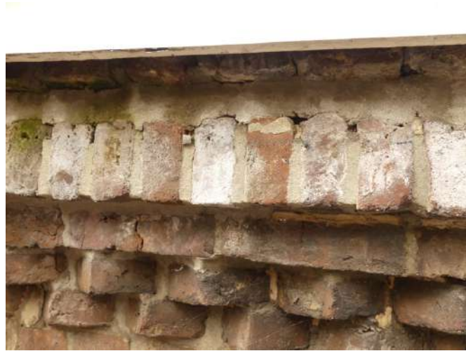
Afb. §22.02 slordig werk met scheurvorming (vroeger mogelijk zgn. vuilwerk achter een profiellijst?)
