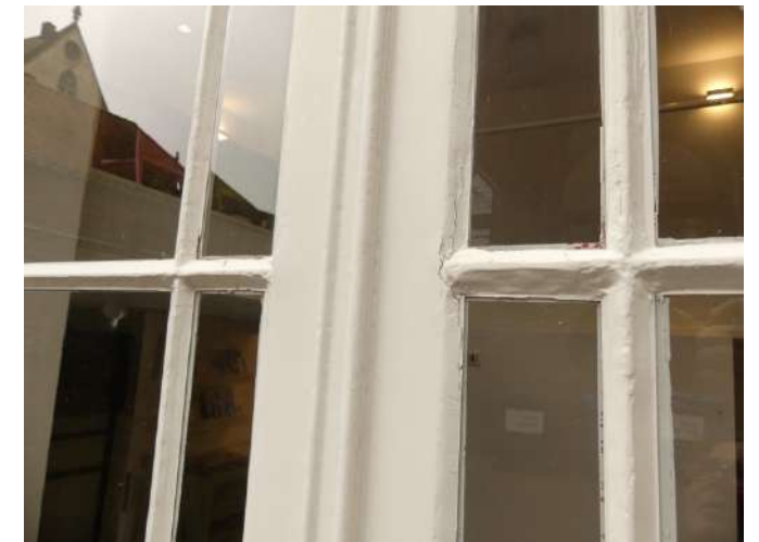
Afb. §46.21.18, barsten in verf, aan binnenzijde te ver op het glas geschilderd
