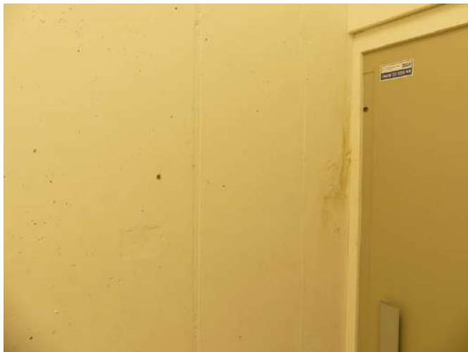
Afb. §46.21.35, beschadigd sauskwerk kelder
