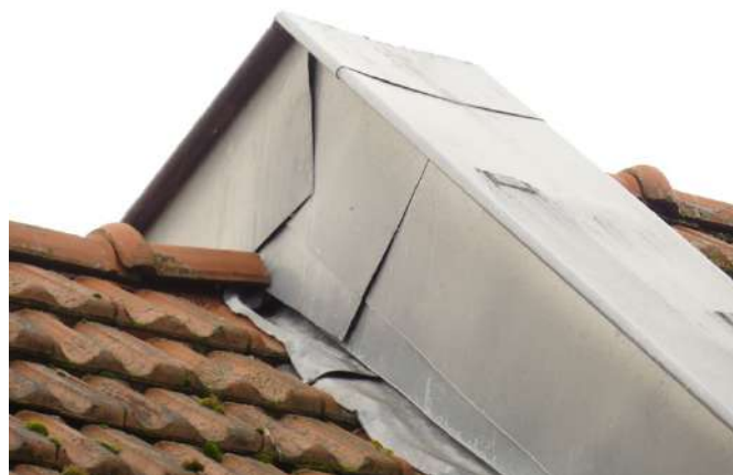
Afb §33.87.22, loshangende overlappen, klagen of andere bevestiging niet waarneembaar, slechte lijn
