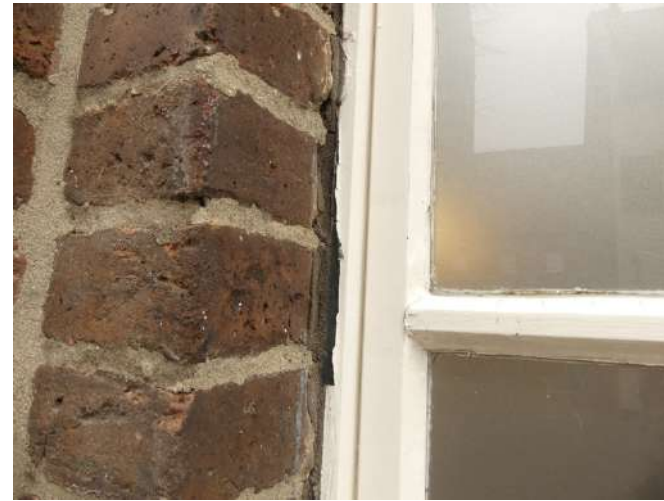
Afb. $46.21.27, slecht afgewerkte aansluiting
