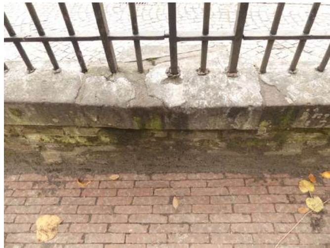
Afb. §35.29, brandlagen, scheuren en grote mortelreparaties
