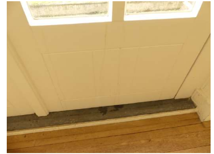
Afb. §30.32, lekkage- of condenssporen
