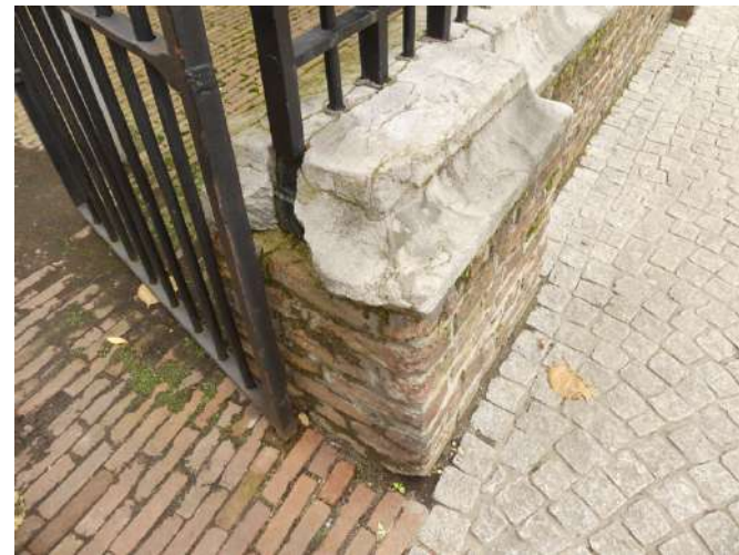
Afb. §35.35, brandlagen, scheuren en afgebroken stuk (door roestvorming hekwerkspijl)
