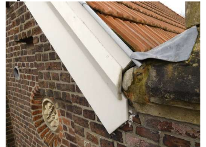
Afb. §35.16, reparatiestuk onvoldoende uitgehaald en met verkeerde mortel
