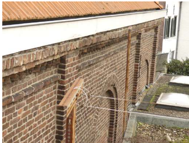
Afb. §46.21.10, schrale verf op (verkeerde) multiplex ondergrond
