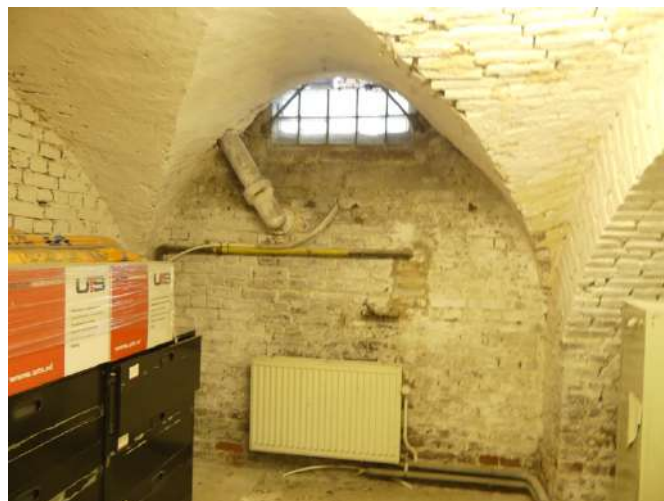
Afb. §22.26 rommelige situatie, diverse leidingdoorvoeren, slechte aanhelingen in muur en gewelf, radiator onder een open (!!) raam, afgefallen pleisterwerk
