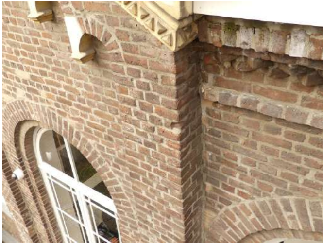
Afb. §22.01 kapotte stenen, slechte reparaties en slordig werk onder de gootplank
