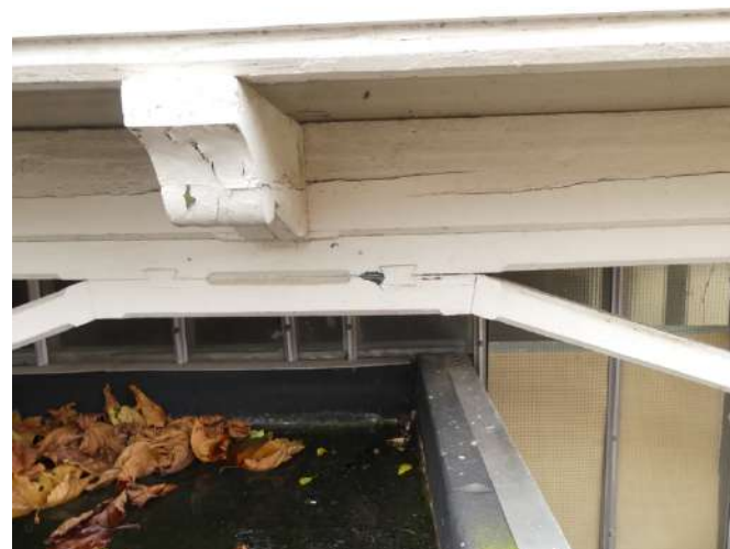
Afb. §24.12, openstaande verbindingen en gescheurd verfwerk
