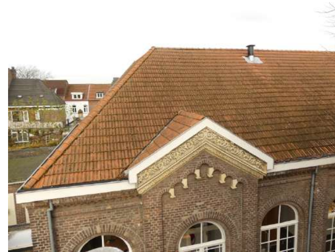
Afb. §33.41.01, oostelijk dak dwarsvleugel, vervuilde pannen en bijzondere detaillering
