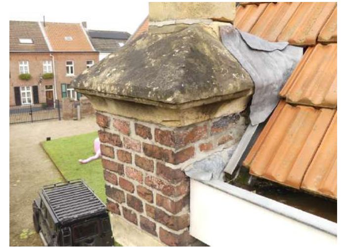
Afb. §35.14, schouderstuk achtergevel, vervuild en uitgevallen voegwerk
