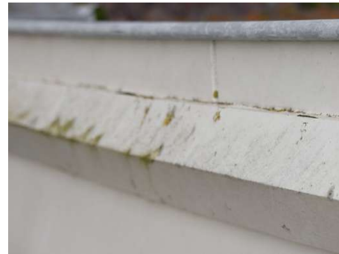
Afb. §46.21.15, vervuiling en algaanslag op verf, gebarsten naad
