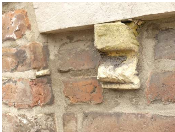
Afb. §35.20, versleten consoles waterslaglijst kozijnen
