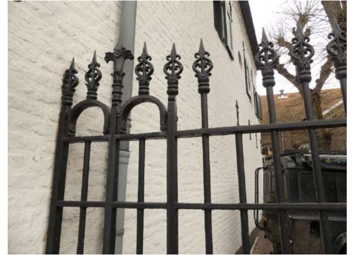
Afb. §43.04, ontbrekende hekwerkpunt, kop en schacht
