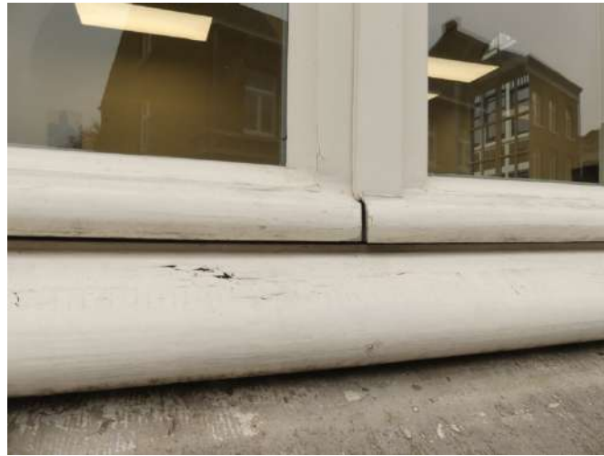
Afb. $46.21.24, gebarsten, verpoederende verf
