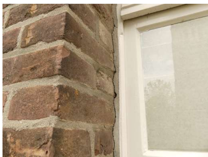
Afb. §30.41, losgescheurde voeg
