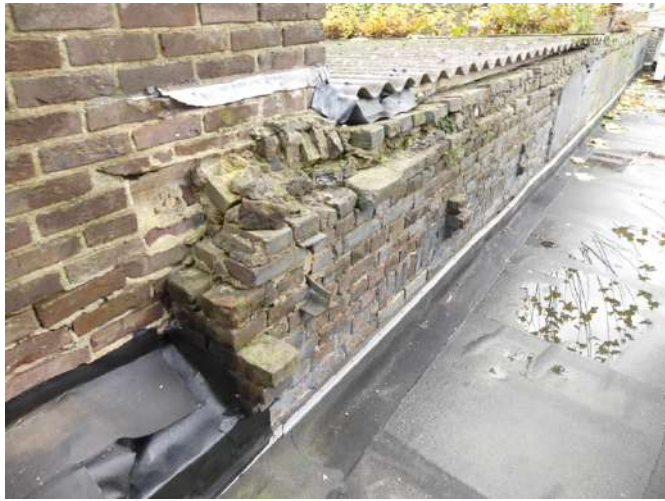
Afb. §33.33.07, aansluiting met knelstrip en kit onderhouds- en lekkagegevoelig, losliggende stenen, zeer rommelig
