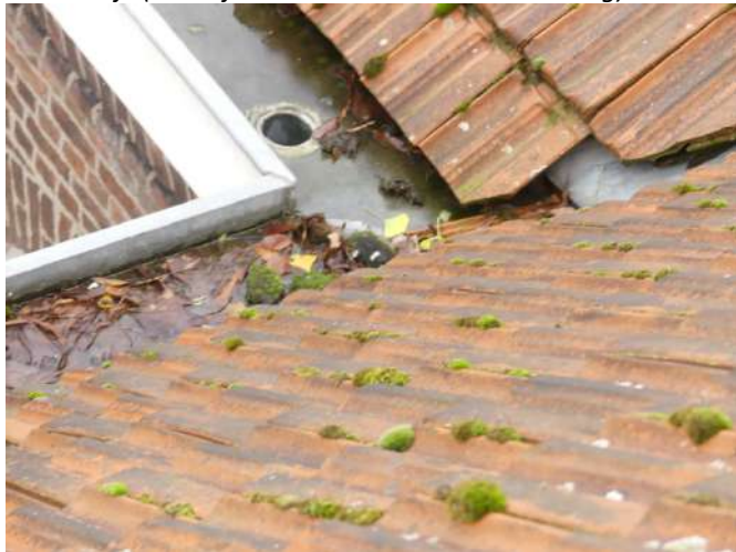
Afb. §33.41.23, afgezaagde te ver doorgelegde voetpannen, afgeschoven dakpan naast kilgoot, veel blad in goot
