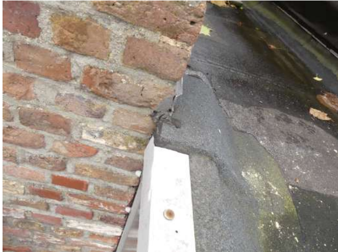
Afb. §33.33.09, aansluiting met knelstrip en kit, losgetrokken - daardoor kans op lekkage
