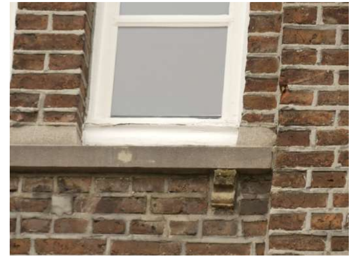
Afb. $46.21.26, gebarsten, verpoederende verf
