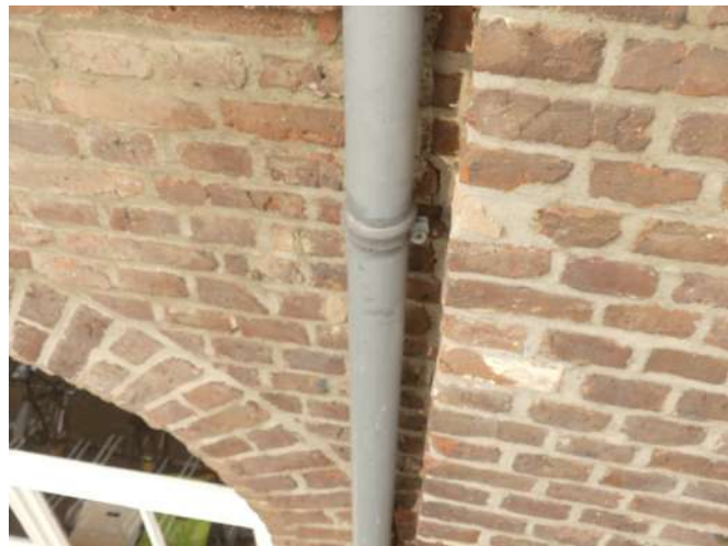
Afb. §22.04 scheur achter de hwa, slechte reparatie
