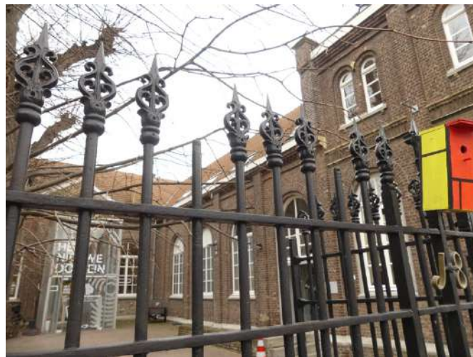
Afb. §43.07, ontbrekende hekwerkpunten en koppen
