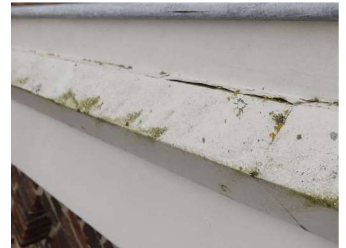
Afb. §46.21.16, vervuiling en algaanslag op verf, gebarsten naad
