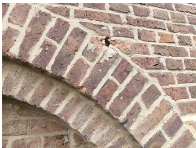
Afb. §22.15 gescheurd metselwerk, mogelijk roestend ijzer achter gat
