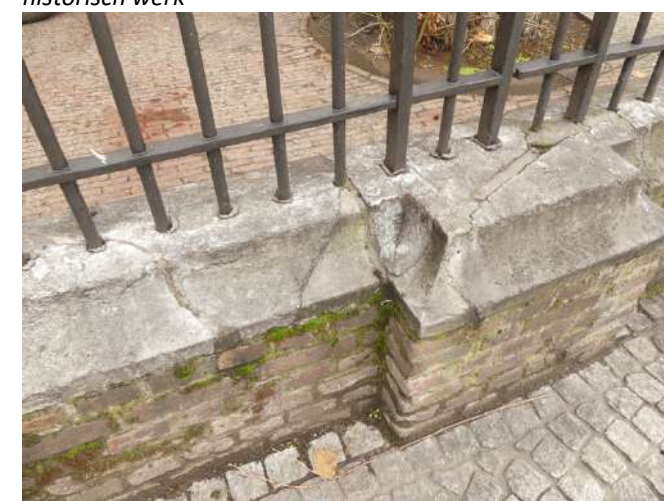
Afb. §35.26, brandlagen, scheuren en grote mortelreparaties
