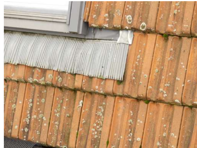
Afb. §33.87.25, dakraam foutief gepositioneerd; dakpan te strak gootstuk overbodig breed gehouden
