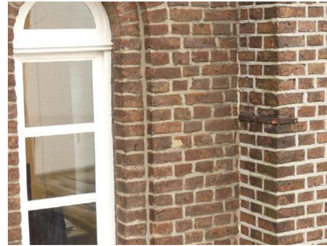
Afb. §22.05 roestend ijzer en slechte reparaties
