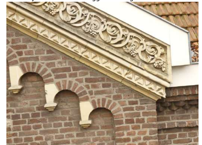
Afb. §35.06, zwaar versleten deel van de frieslijst, detaillering deels verdwenen
