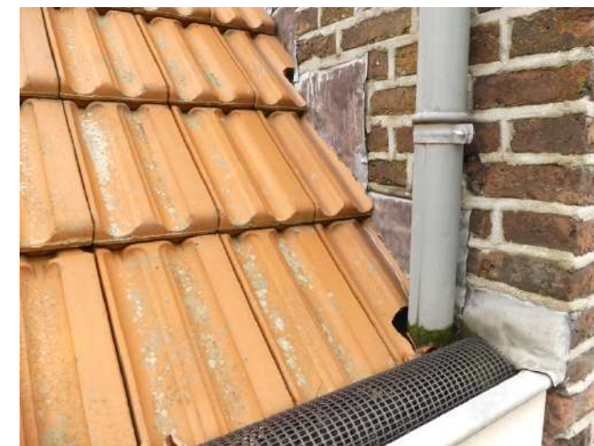
Afb. §33.41.16, te ver doorgelegde dakpannen; de hwa loopt in de dakgoot
