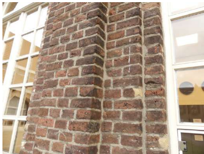
Afb. §22.11 gescheurd metselwerk, slechte reparaties
