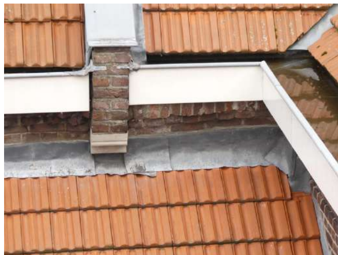
Afb. §33.87.12, onvoldoende aangebracht muurlood bij elke aansluiting op deze plek
