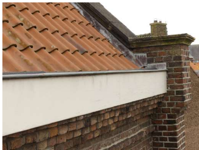
Afb. §33.87.09, te lang muurlood onder afdek, onvoldoende overlap onder muurloket
