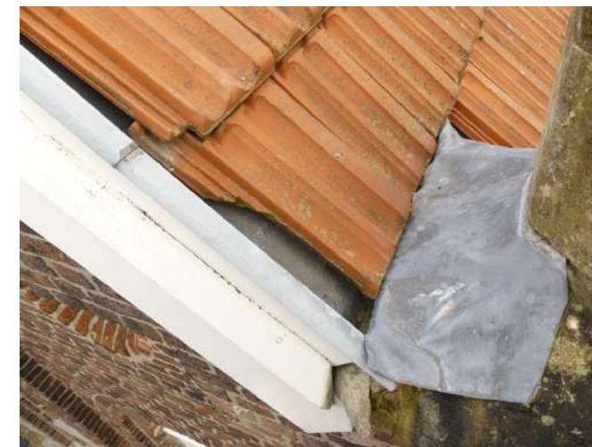
Afb. §33.87.14, onvoldoende aangebracht lood, functie en doel onduidelijk, afdichting zeer twijfelachtig
