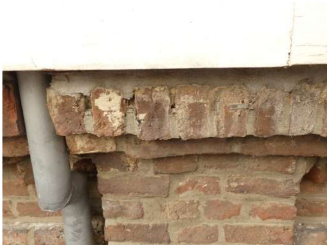
Afb. §22.03 slordig werk, open voegen, barsten in schilderwerk
