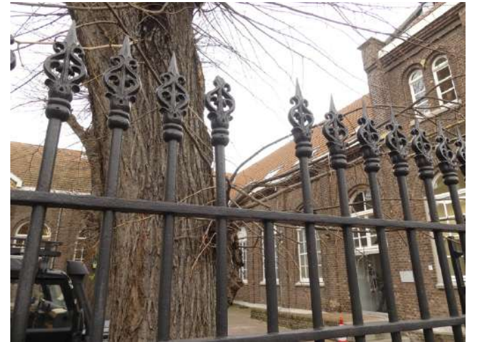
Afb. §43.06, ontbrekende hekwerkpunten, kop en schacht
