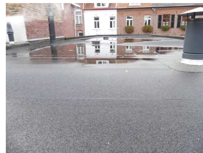
Afb. §33.33.04, plat dak op overkapt deel speelplaats niet op afschot
