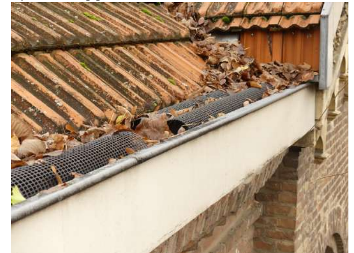
Afb. §33.41.06, zeer rommelig en onduidelijk uitgevoerd detail, afgezaagde voetpannen....amateurisme
