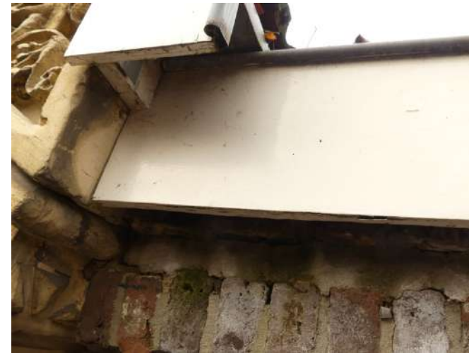
Afb. §46.21.01, schrale verf op (verkeerde) multiplex ondergrond
