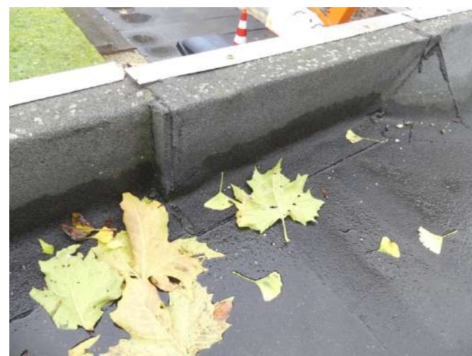
Afb. §33.33.05, ondeskundig uitgevoerd detail bij verspringing
