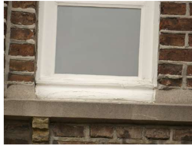
Afb. $46.21.25, gebarsten, verpoederende verf
