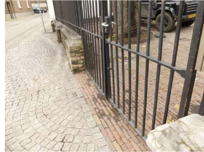
Afb. §43.03, poorten in gesloten toestand, sluitstijlen sluiten niet goed
