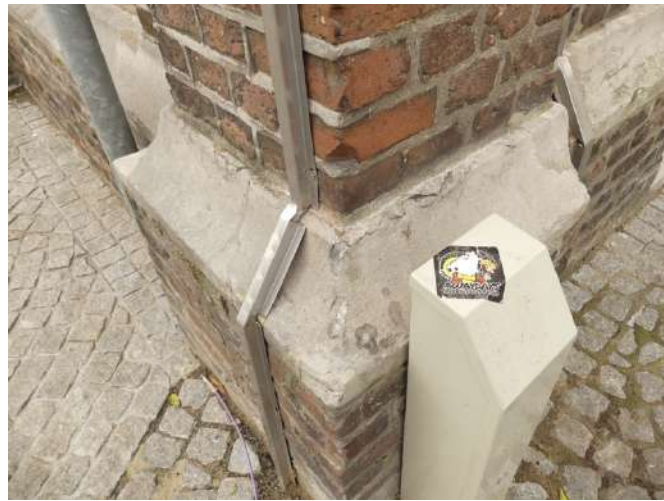
Afb. §35.42, scheuren en steken, brandlagen en mortelreparaties
