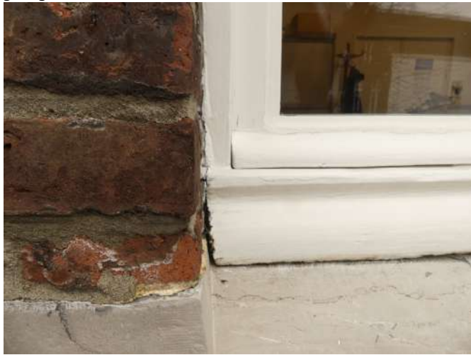
Afb. $46.21.23, barsten in verf en loslatend vanaf kops einde
