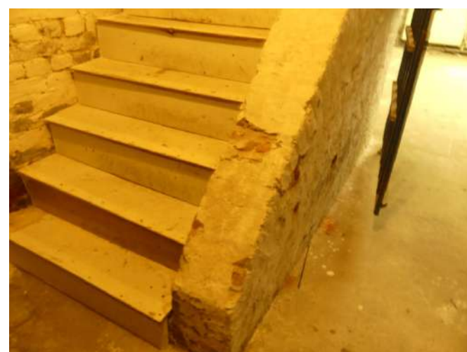
Afb. §22.21 gescheurde en beschadigde trapmuur
