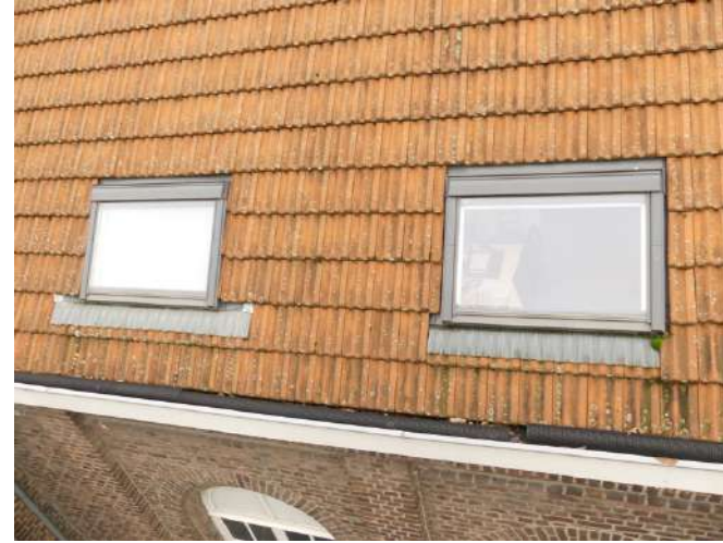
Afb. §33.87.23, moderne dakvensters op dak oostelijke speelplaats, onderdetail rechtse raam aan beide zijden verschillend uitgevoerd
