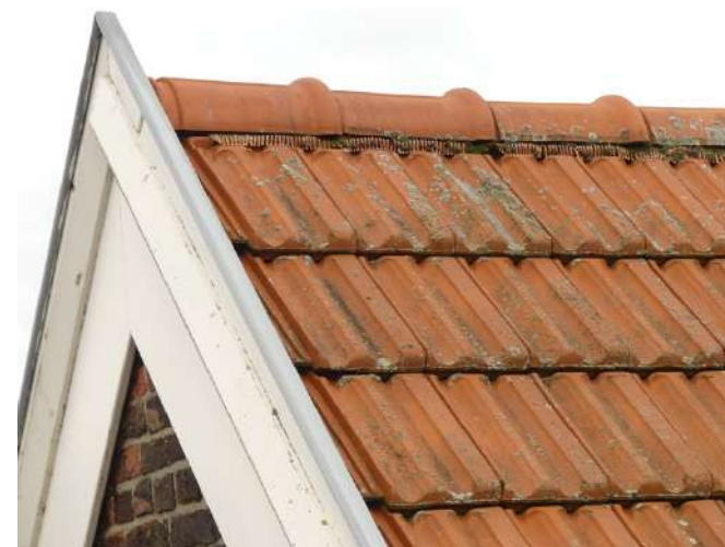
Afb. §33.41.16, beëindiging achtergevel dwarskap met rommelig aangebrachte, en te korte, ondervorst met mosgroei
