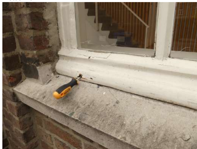
Afb. §30.15, weggerotte onderdorpel onder ogenschijnlijk intacte verflaag (lemmet priem volledig in zacht hout)
