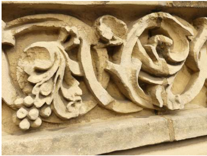
Afb. §35.07, detail zware slijtage, degraderend werk
