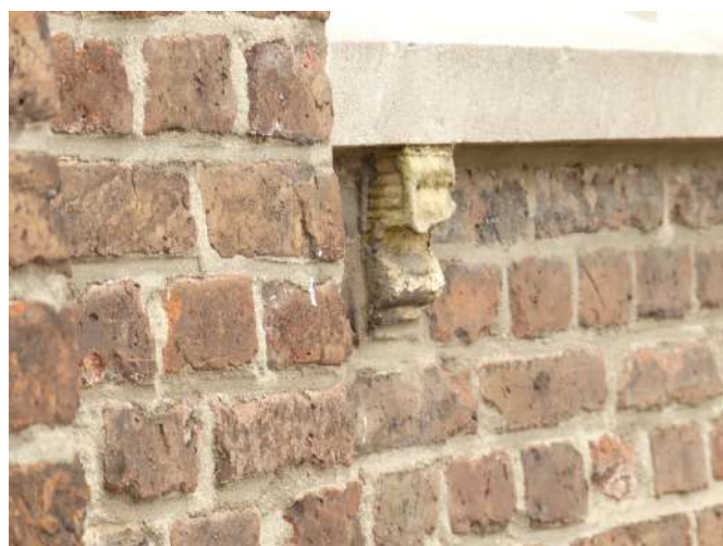
Afb. §35.21, versleten consoles waterslaglijst kozijnen
