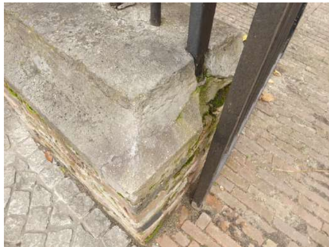
Afb. §35.32, afgebroken stuk mortelreparatie (roest niet verholpen)
