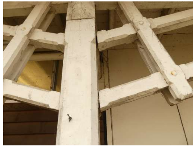
Afb. §24.08, openstaande verbindingen, roestvorming op schroeven
