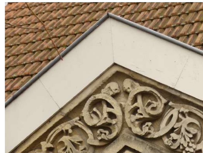
Afb. §46.21.05, schrale verf op (verkeerde) multiplex ondergrond
