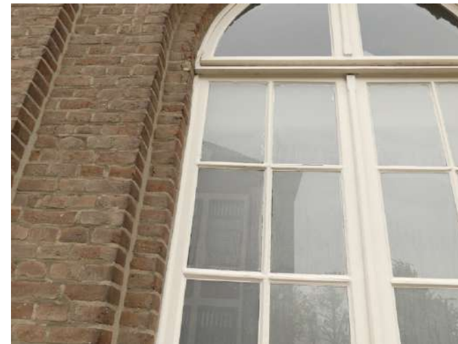
Afb. §22.09 gescheurd metselwerk (thv kalf)
