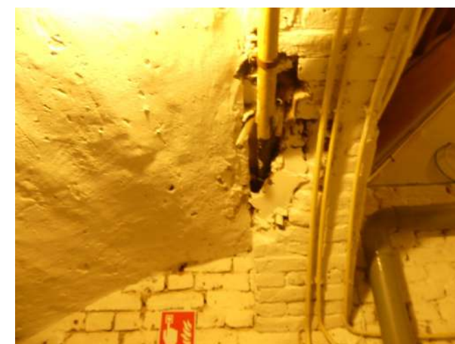
Afb. §22.22 onzorgvuldig gepositioneerde en aangebrachte leidingen
