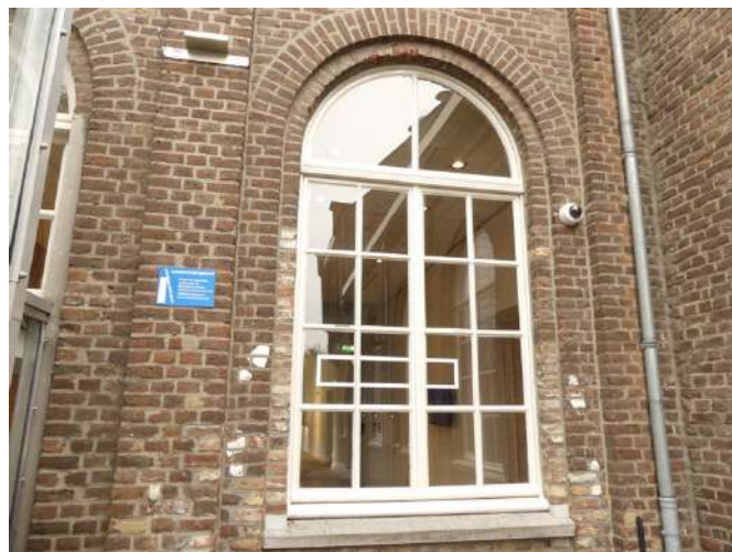
Afb. §30.13, raamkozijn ipv speelplaats/gangdeur ingeboet metselwerk
