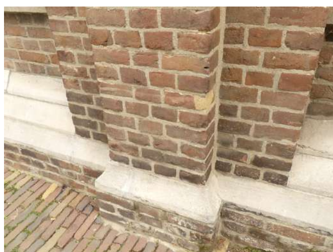
Afb. §22.16 slechte reparatiel
