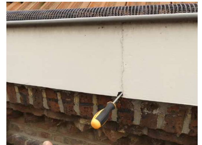
Afb. §46.21.06, aangetast hout bij rechte stuiknaden
