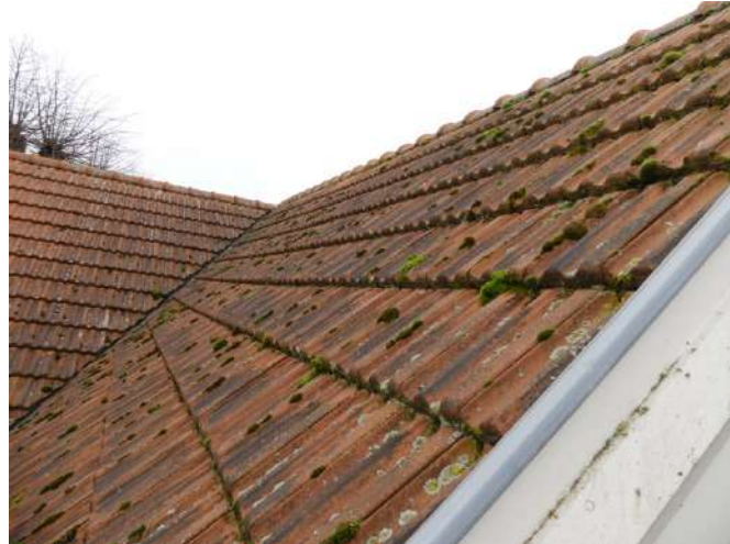
Afb. §33.41.22, met o.a. mosgroei vervuilde dakpannen en niet doorlopende pannenlagen aan weerszijde van de kilgoot
