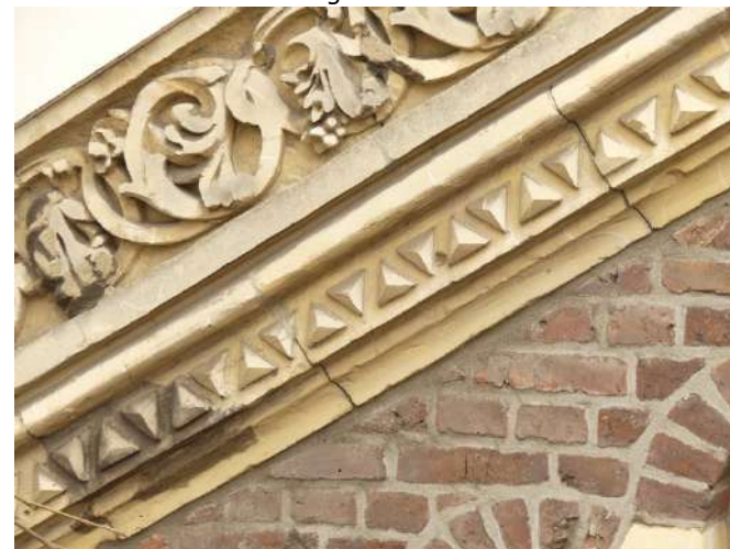
Afb. §35.05, zwaar versleten deel van de frieslijst, detaillering deels verdwenen
