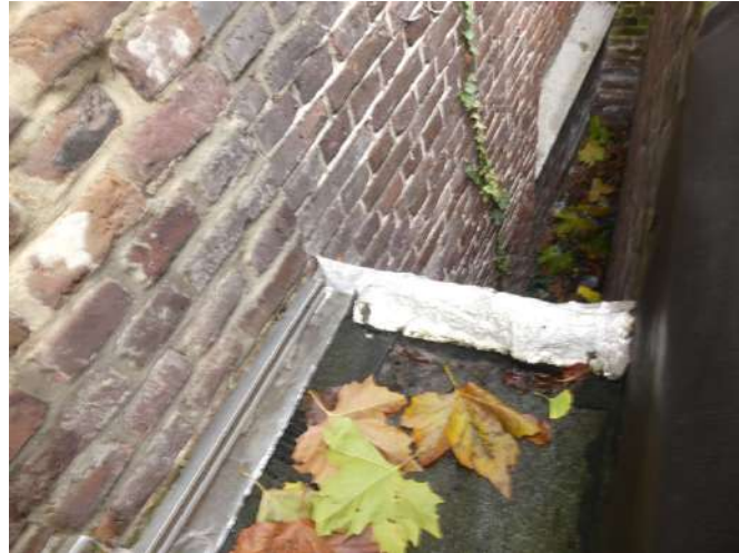
Afb. §33.33.10, rand afgewerkt met oneigenlijk materiaal, lijkt bituumtape, is amateurisme
