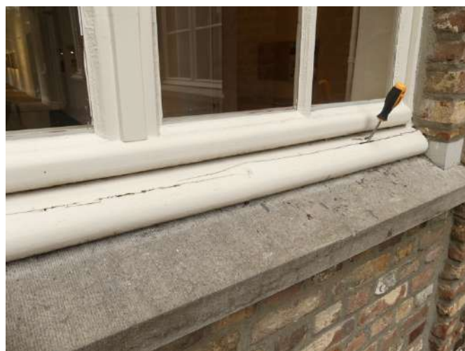
Afb. §30.18, gebarsten verf, mogelijk op onvoldoende voor- Handelde windscheuren, met algroei
