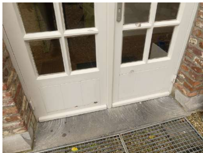
Afb. §30.38, slecht afgestelde deuren
