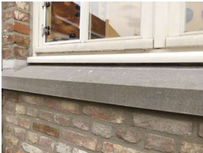
Afb. §46.21.31, slecht schilderwerk op onderzijde raamdorpels
