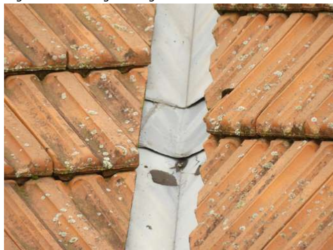
Afb. §33.41.12, scheefgezakte kilgootbekleding
