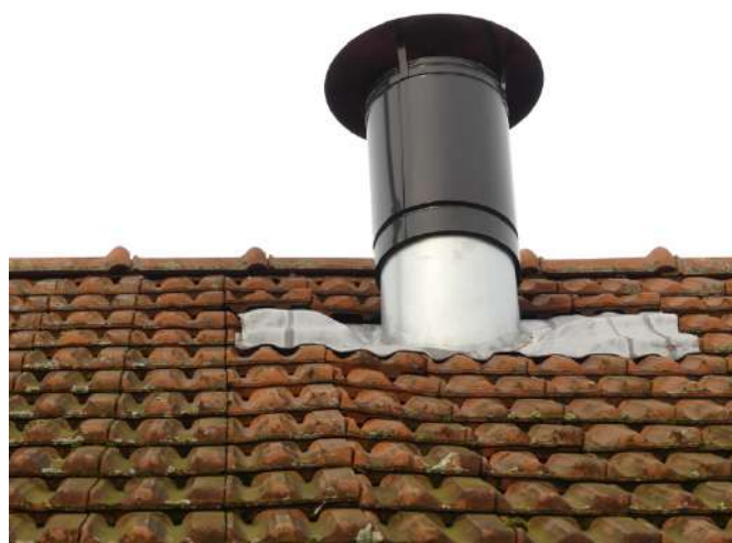
Afb. §33.41.09, dakpannen lijken iets in te zakken onder de dakdootvoer
