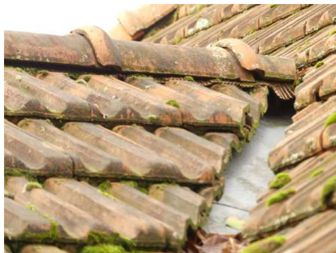
Afb. §33.41.08, om onduidelijke reden afgezaagde nokvorst op insteekkapje, te smalle kilgoot
