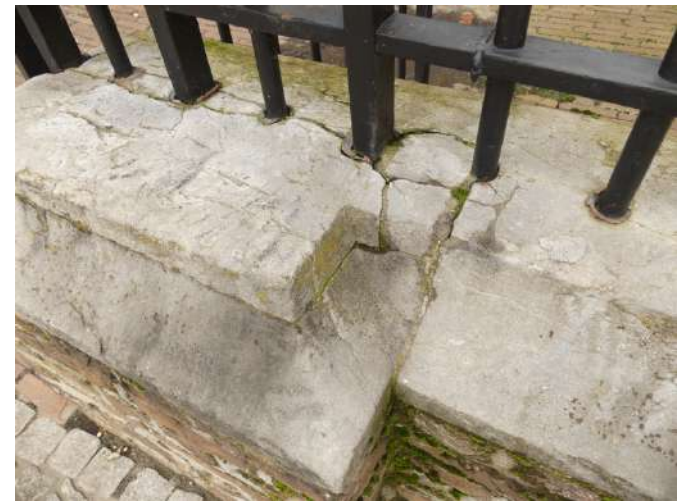
Afb. §35.36, brandlagen en scheuren, ook in reparatie-opzetstuk
