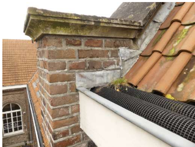
Afb. §33.87.07, onvoldoende aangebracht en aangeklopt lood
