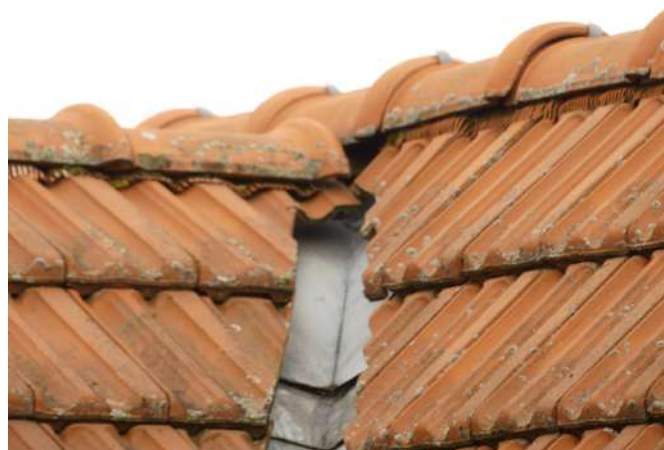
Afb. §33.41.11, nog niet voltooide, maar in ieder geval zeer ondeskundig uitgevoerde, aansluiting twee nokken en kilgoot, zeer vreemd gezaagde bovenpannen aan weerszijden kilgoot
