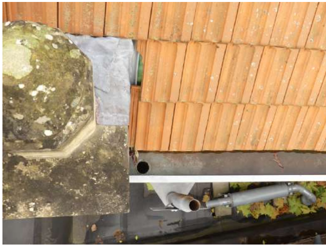
Afb. §33.41.19, aangetroffen toestand, kapotte dakpan gedekt met 'garantie' op lekkage (geen breukrest aangetroffen)
