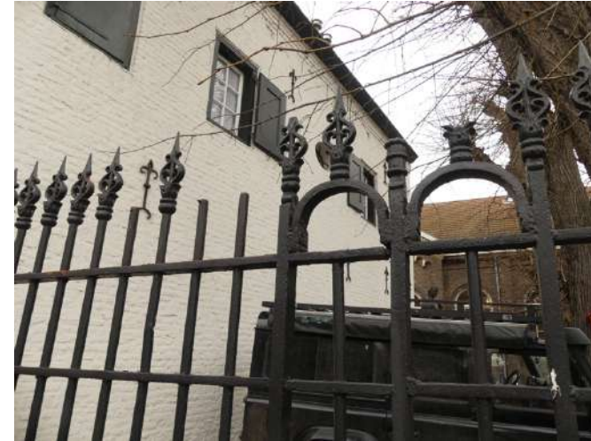
Afb. §43.05, ontbrekende hekwerkpunten en koppen
