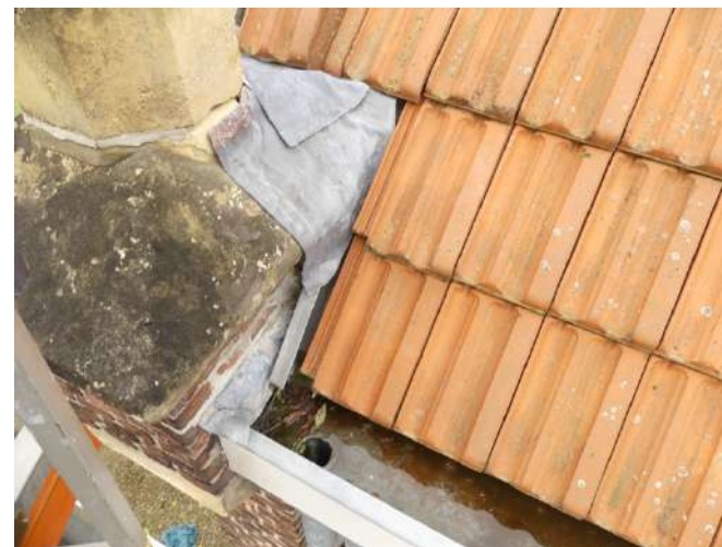
Afb. §33.87.13, onvoldoende diep aangebracht en daardoor uitzakkend loodwerk, in hoek bij dakpan lekkagerisico
