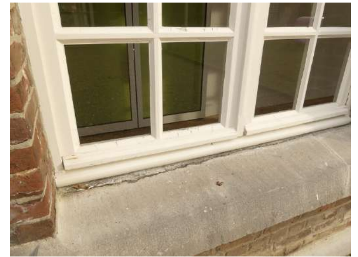
Afb. $46.21.30, gebarsten, loslatende verf op modern, vervangen kozijn en ramen
