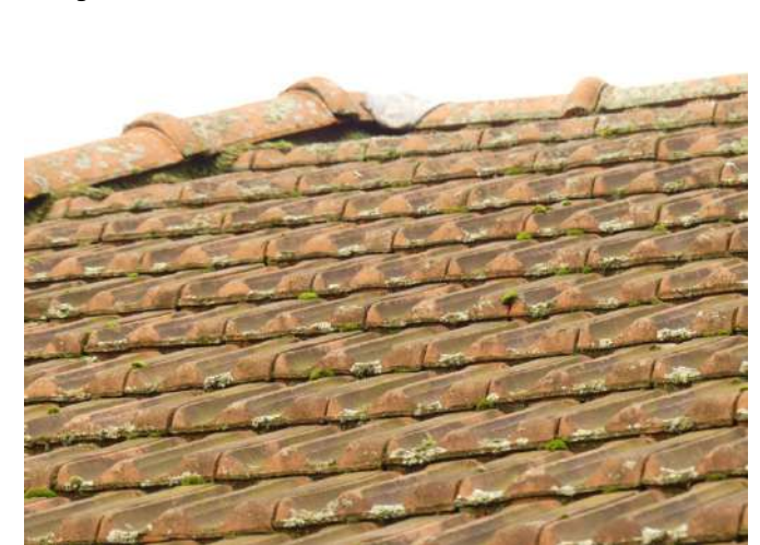
Afb. §33.41.04, lijn hoekkeper en nok kloppen niet, loden lapje op aansluiting gekit
