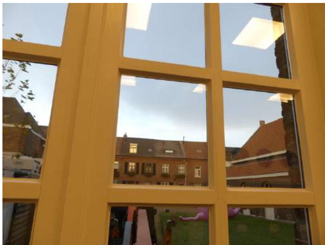
Afb. §46.21.33, slecht schilderwerk op binnenzijde glaslatjes
