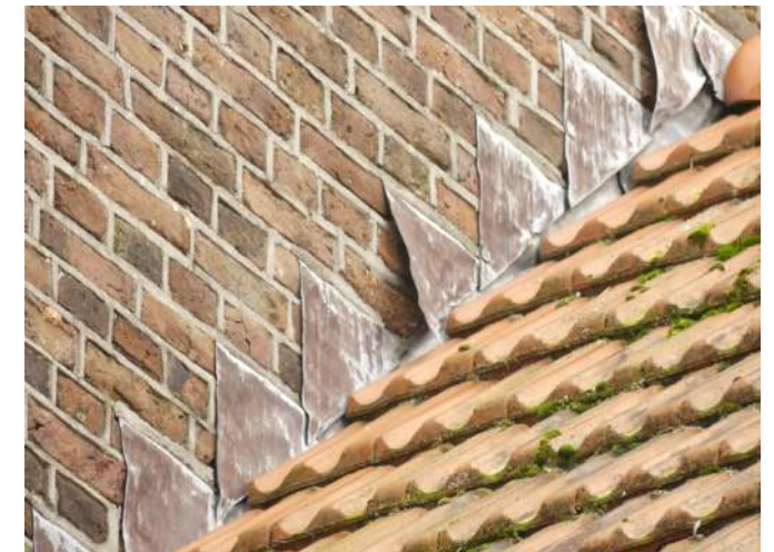
Afb. §33.87.06, opgewaaide muurloketten en onvoldoende opgezet muurlood
