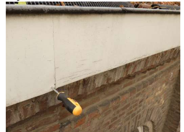
Afb. §46.21.04, aangetast hout bij rechte stuiknaden
