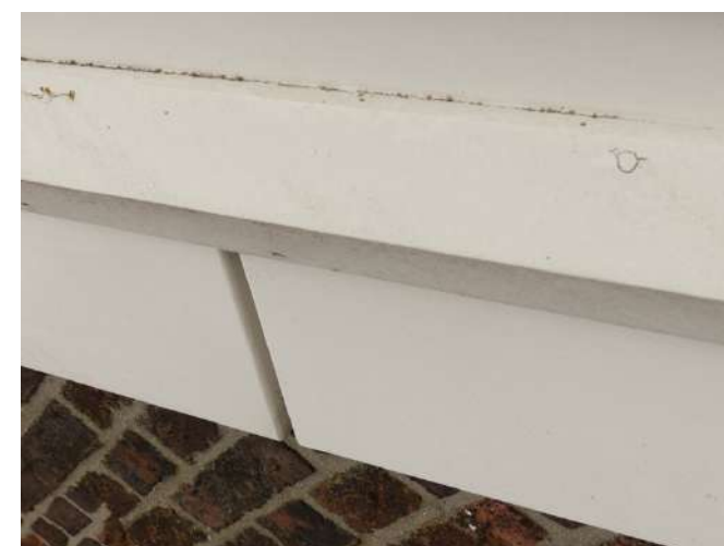
Afb. §24.04, loskomende bevestiging betimmering
