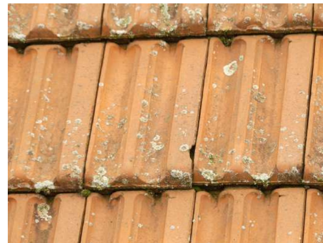
Afb. §33.41.15, een enkele beschadigde dakpan
