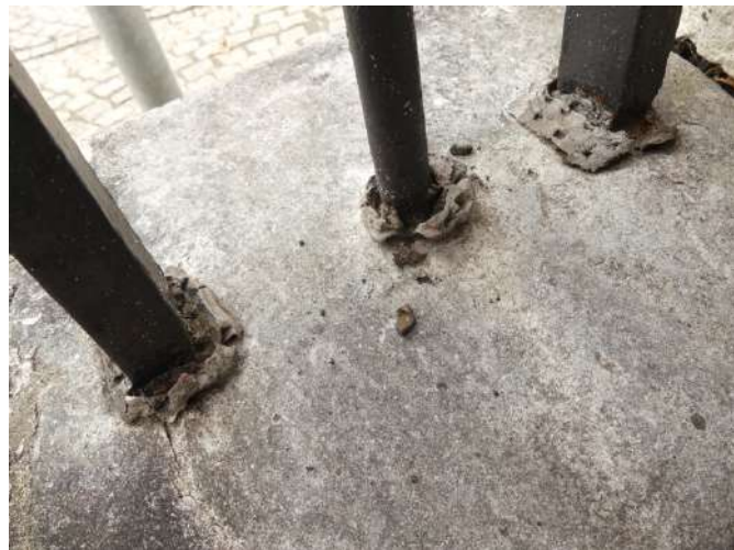
Afb. §35.31, (vermoedelijk) origineel aangedreven lood rondom hekwerkspijlen in muurafdeklijst, enigszins weggeteerd
