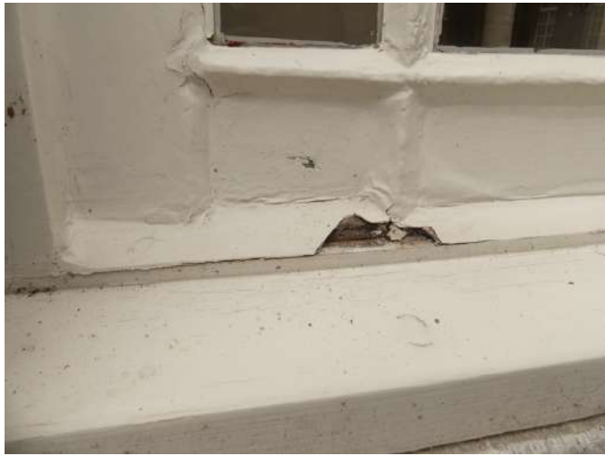
Afb. $46.21.19, loslatende verf tpv roede (roest?)
