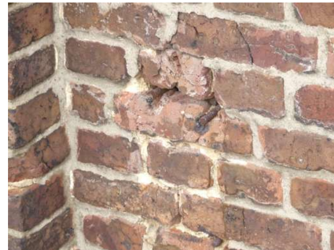
Afb. §22.07 schade door roestend ijzer, uitgespoeld voegwerk
