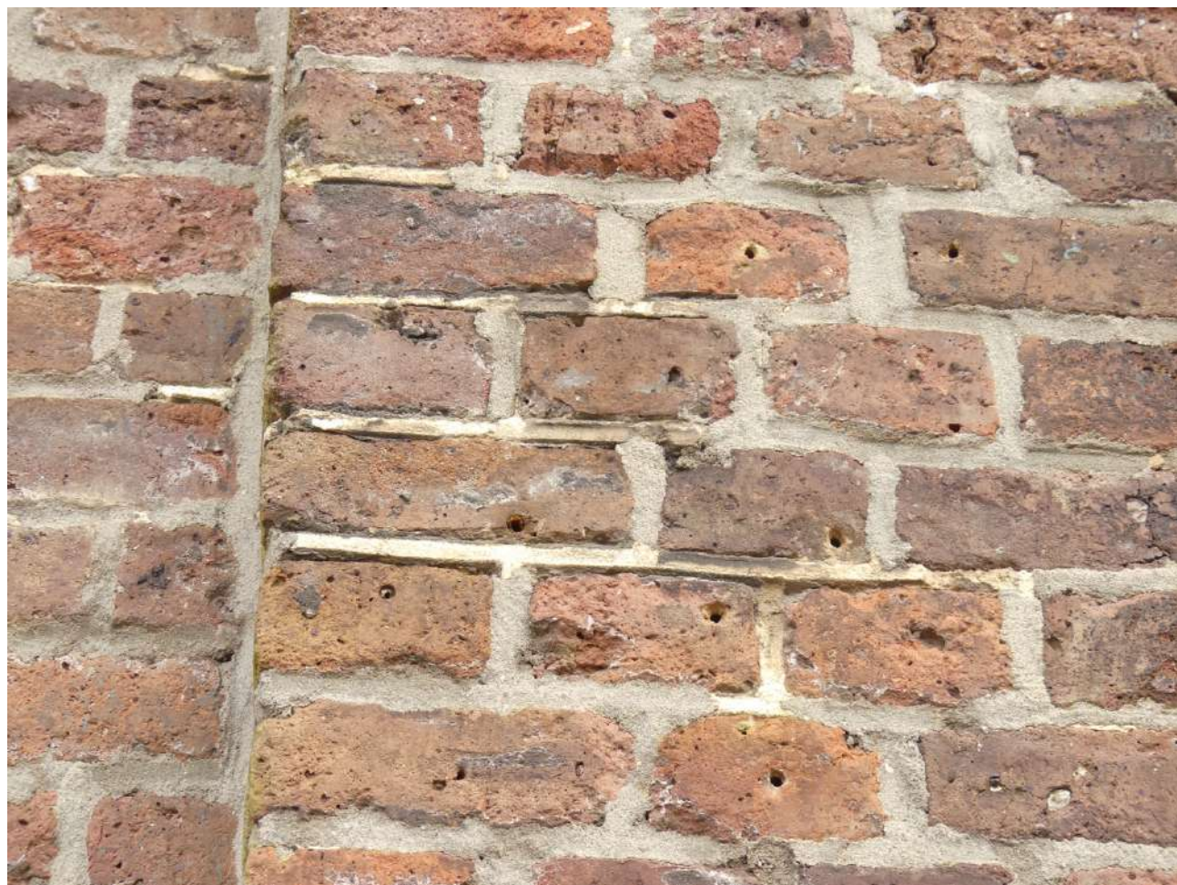
Afb. 28: westgevel dwarsvleugel met sporen van vermoedelijk origineel voegwerk
