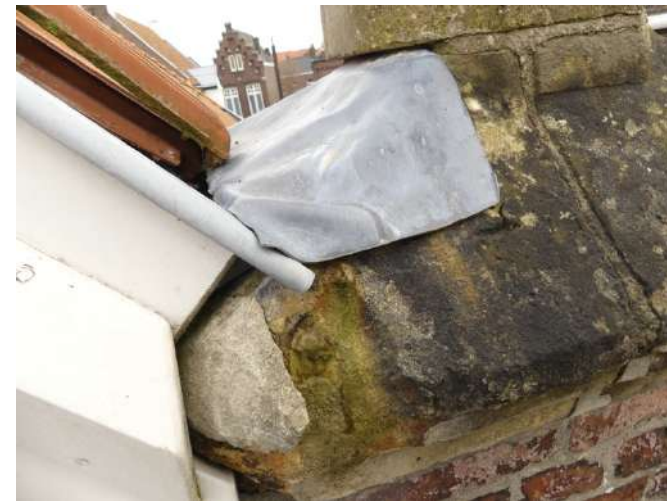
Afb. §35.15, reparatie onvoldoende uitgehaald en met verkeerde mortel
