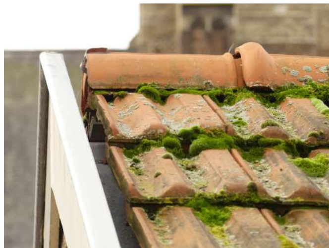
Afb. §33.41.07, om onduidelijke reden afgezaagde nokvorst op insteekkapje, mosgroei op bovenpannen
