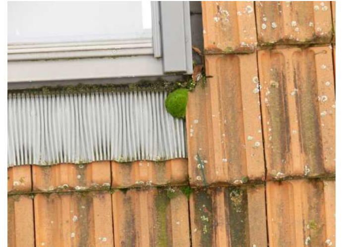
Afb. §33.87.26, dakraam foutief gepositioneerd: dakpan aan zijkant en onderzijde (op slechte wijze) pasgezaagd, daardoor mosgroei
