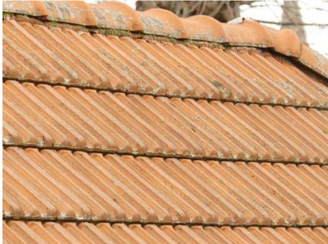
Afb. §33.41.21, aansluiting hoekkeper op nok, afdichting onduidelijk (lood lijkt niet overal dekkend aanwezig)
