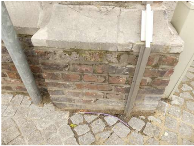
Afb. §35.41, scheuren en steken, brandlagen en mortelreparaties
