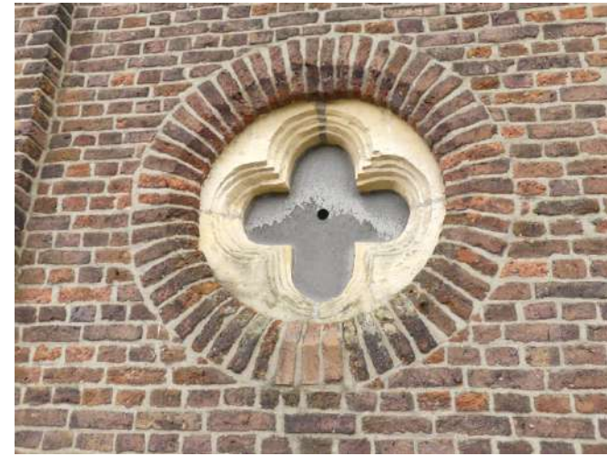
Afb. §35.13, omlijsting vierpasvenster zolder, onderzijde versleten
