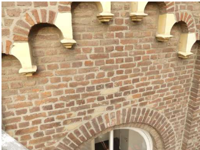
Afb. §35.09, friesconsoles met versleten/beschadigde basementjes
