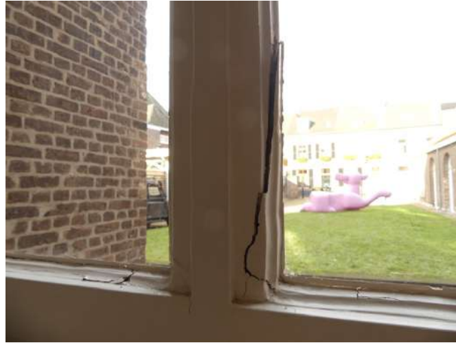
Afb. §30.28, detail deformatie, lijkt overgeschilderd te zijn
