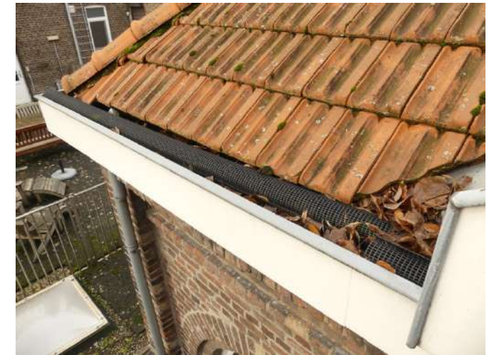
Afb. §33.41.02, ondeskundig aangebracht, disfunctionerend bladgaas
