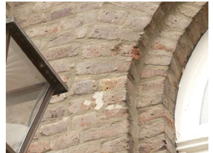
Afb. §22.10 kapotte steen, slechte reparatie
