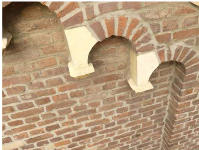
Afb. §35.10, beschadigde basementjes feisconsoles
