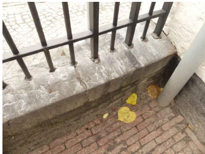
Afb. §35.30, brandlagen, scheuren en grote mortelreparaties
