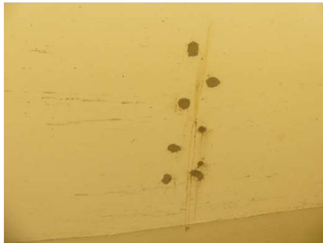
Afb. §46.21.36, beschadigd sauskwerk kelder
