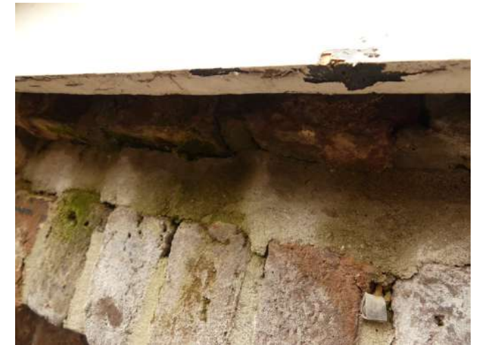
Afb. §46.21.02, door onvoldoende verf op kopse zijde gootlijst aangetast hout
