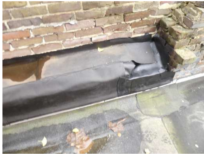
Afb. §33.33.08, noodoplossing? Stroken op metselwerk óver knelstrip geplakt, waarom? Waarom niet degelijk gemaakt?
