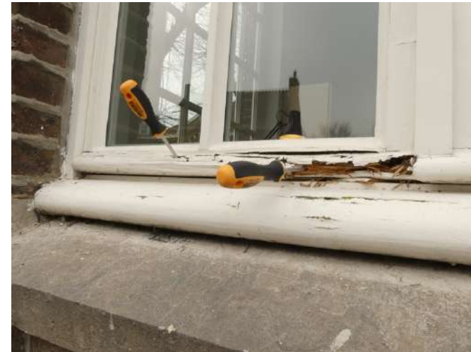
Afb. §30.09, volledig weggerotte raamdorpel, barsten in verfwerk met algroei op kozijndorpel
