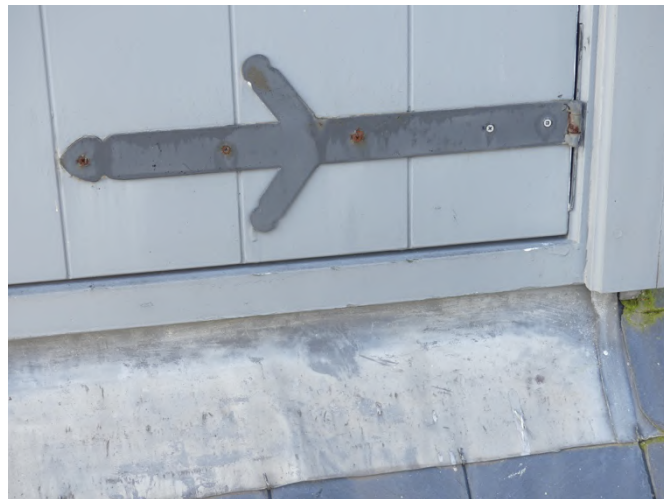
Afb. §46.21.11, roestvorming en erg mat schilderwerk gehengen, glimt normaal gesproken
