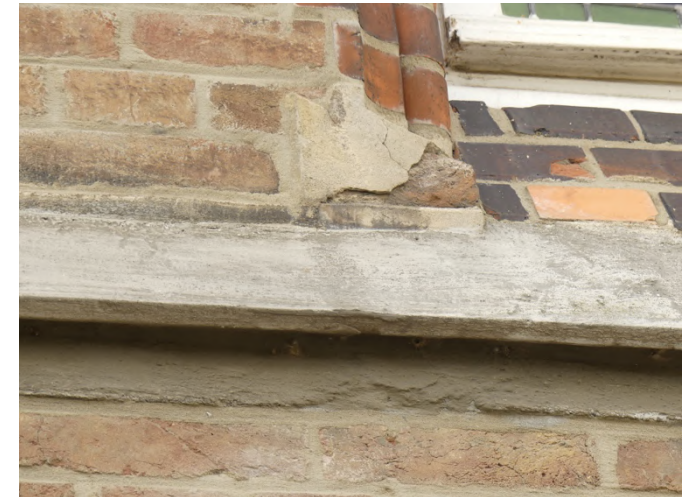
Afb. §22.08 afgefallen pleisterwerk en detonerende steen in de afzaat, door (vermoedelijk) verkeerde keuze steen
