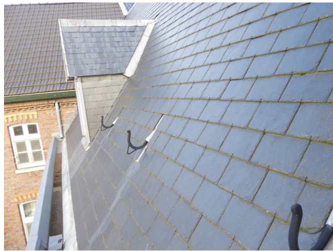
Afb. §33.08, overzicht westelijk dak, boven cour, slecht afschot van de dakgoot
