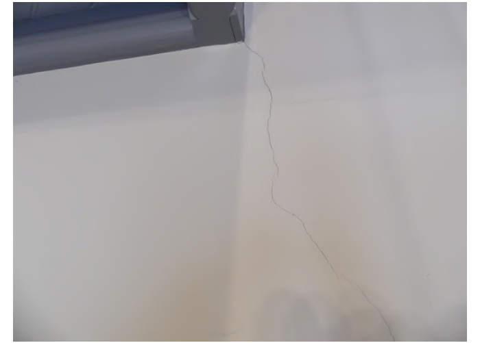
Afb. $40.12, scheur vanaf balkoplegging
