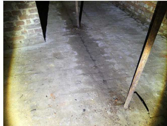
Afb. §89.11, roest- en vochtsporen onder de leiding
