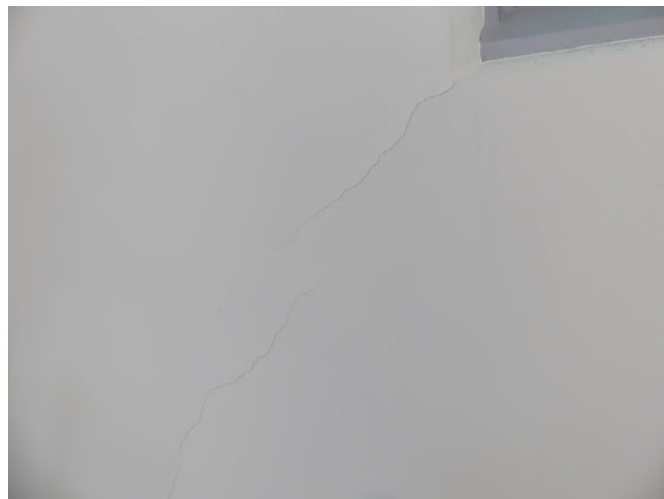
Afb. $40.10, scheur vanaf raamopening
