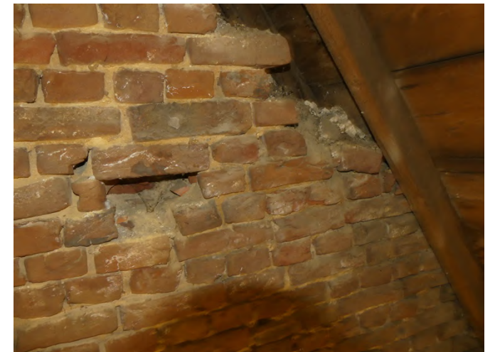
Afb. §22.10 uitgevallen stenen aan binnenzijde topgevel
