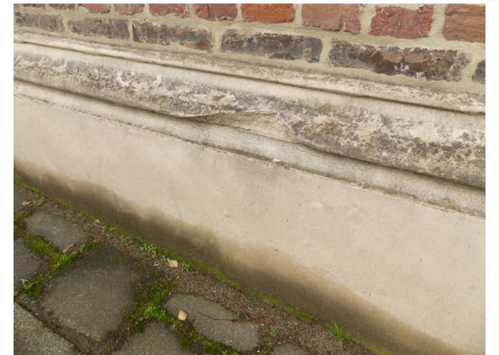
Afb. §40.02, afgebroken profiellijst
