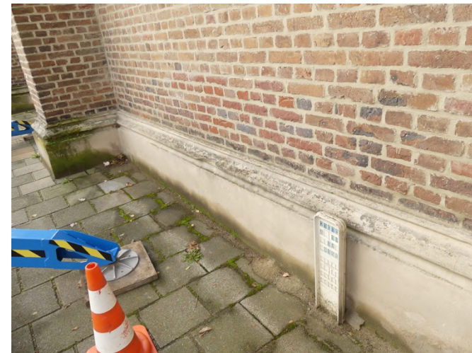
Afb. §40.01, beschadigde profiellijst op de plint, vochtintrekking boven straatwerk
