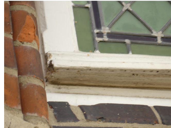
Afb. §22.07 beschadigde profielsteen en weinig/geen verf op kopse kant raamdorpel
