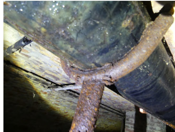
Afb. §89.07, verroeste steunen onder de leiding
