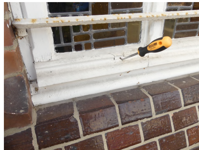
Afb. §30.05, gescheurde verf en ingerot hout onderdorpel
