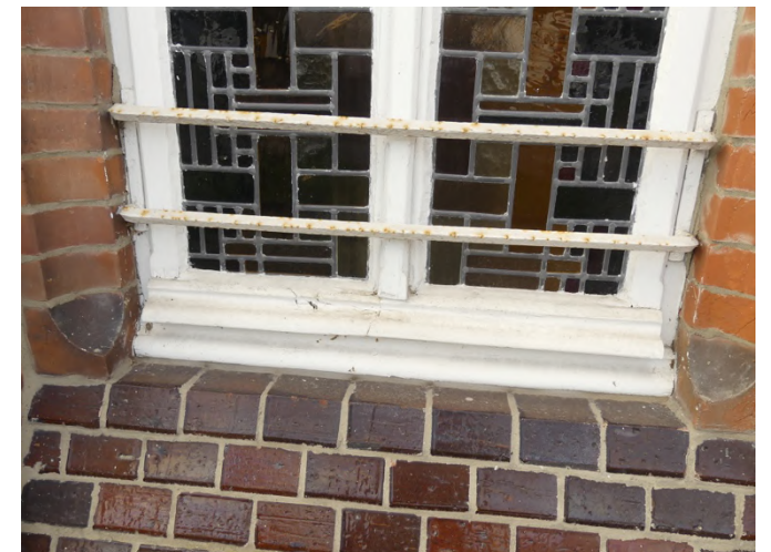
Afb. §30.04, roestvorming op de beschermingsijzers (NB: in 2014 gerenoveerd en nu al roest!?)
