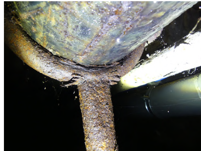
Afb. §89.09, volledig verroeste steun onder de leiding
