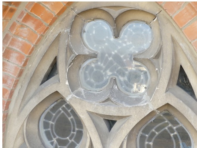
Afb. §35.04, uitgespoeld voegwerk
