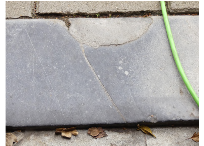
Afb. §35.08, gescheurde deurdorpel en slecht gerepareerd stuk
