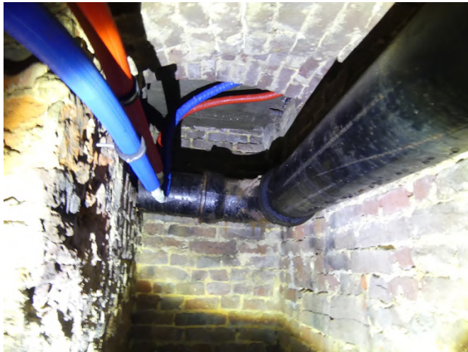
Afb. §89.05, overzicht divers leidingwerk met luik
