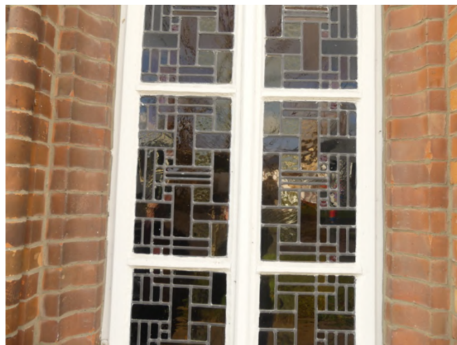
Afb. §30.07, ongelijke roedes, afstelling of verkeerd gehangen?
