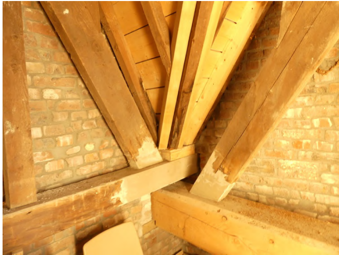
Afb. §24.01, polymeerchemisch herstellde balkkoppen, er ligt veel grof stof en zaagsel op de balken en zoldervloer
