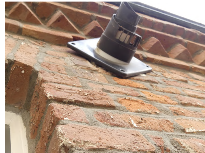
Afb. §22.09 slordig aangebrachte, loszittende geveldoorvoer
