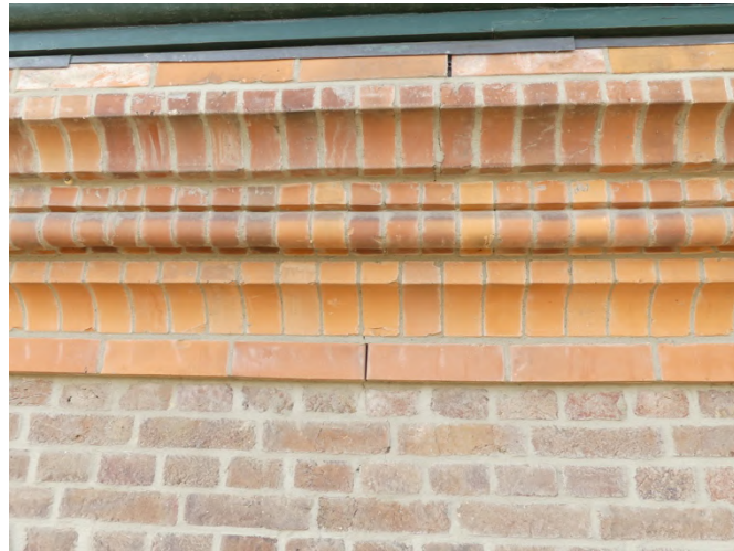
Afb. §22.02 uitgevallen stootvoegen
