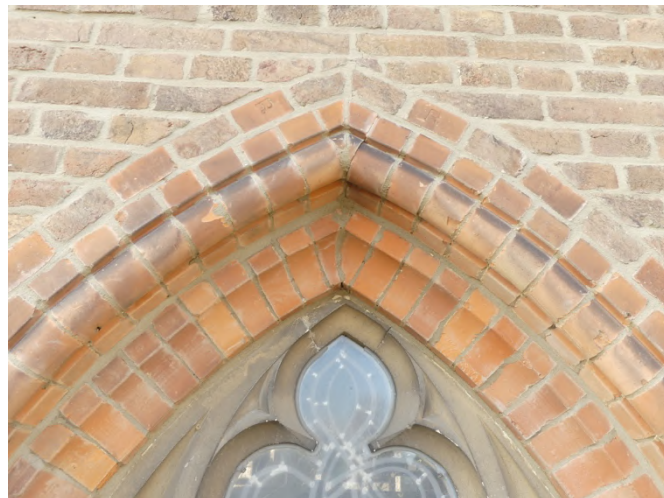
Afb. §22.04 losgescheurde, iets verzakte profielstenen – oude zetting die waarschijnlijk nog steeds beweging heeft
