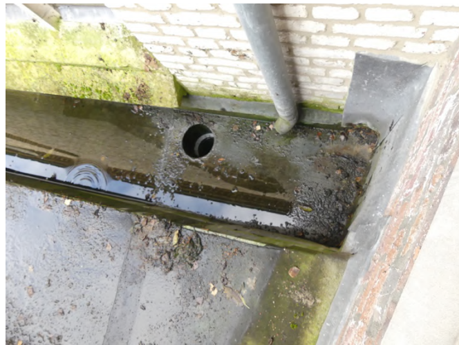
Afb. §33.10, ook rondom afvoer afschot niet op orde
