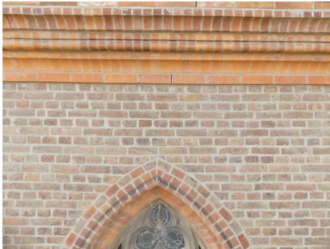
Afb. §22.01 terugkomende scheurvorming boven spitsboogvenster
