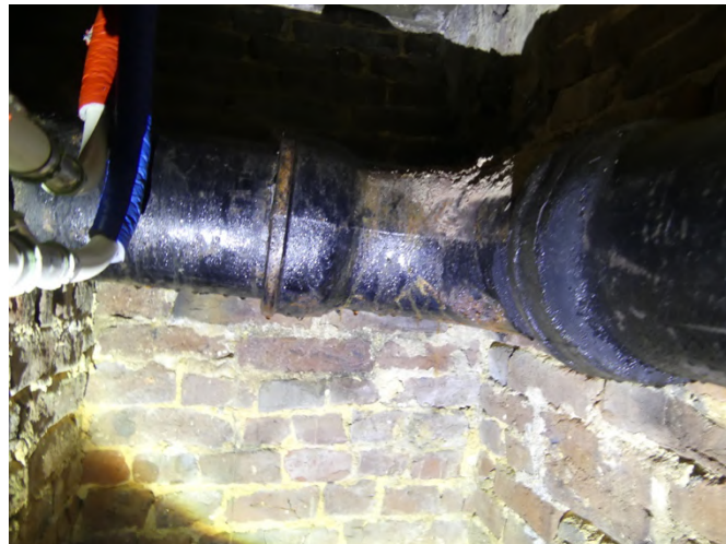
Afb. §89.06, roestvorming op onderzijde leiding
