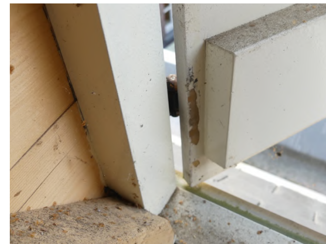
Afb. §46.21.17, binnenzijde dakkapelluik, gesloten met te natte verf, daardoor volledig onthecht
