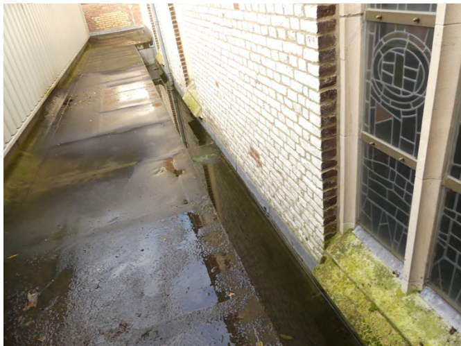
Afb. §33.09, dakgoot overdekte binnenplaats niet op afschot
