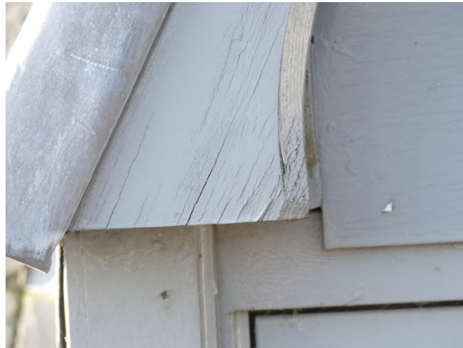
Afb. §46.21.09, volledig scheurende verf onderzijde lijstwerk
