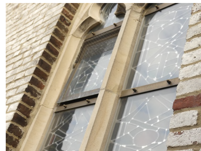
Afb. §30.18, openstaand tuimelraam, niet meer functioneel ivm glas in lood aan binnenzijde
