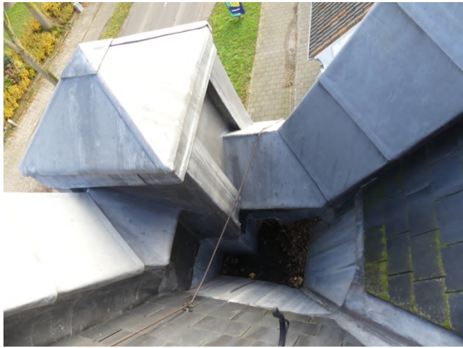
Afb. §33.07, op het overliggende dakvlak een kritisch punt voor verstopping – vervuiling met bladafval
