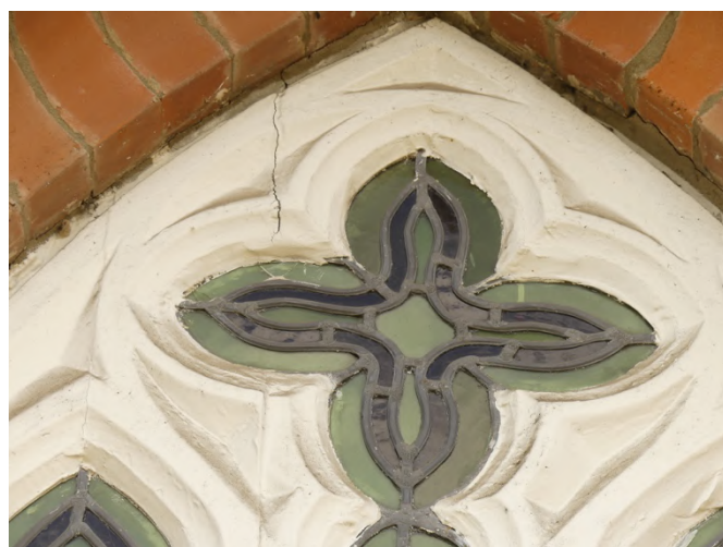
Afb. §30.10, gescheurde verbinding
