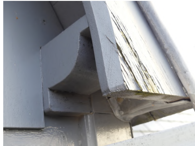
Afb. §46.21.10, volledig scheurende verf onderzijde lijstwerk
