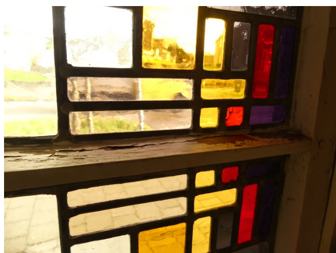
Afb. §30.12, afbladderende, slecht hechtende verf, vermoedelijk door belasting met condens of lekwater
