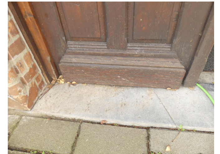
Afb. §46.21.18, schrale verf op de onderzijde van de toegangsdeur
