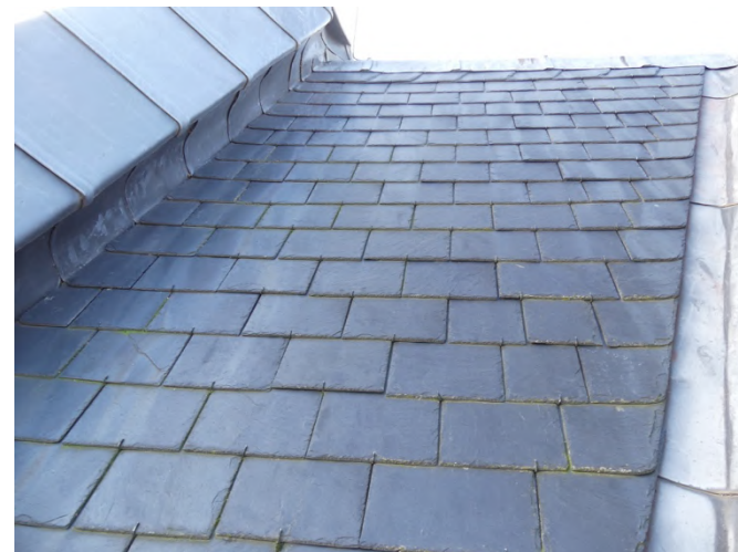
Afb. §33.05, op het dakvlak boven de sacristie gapende leien
