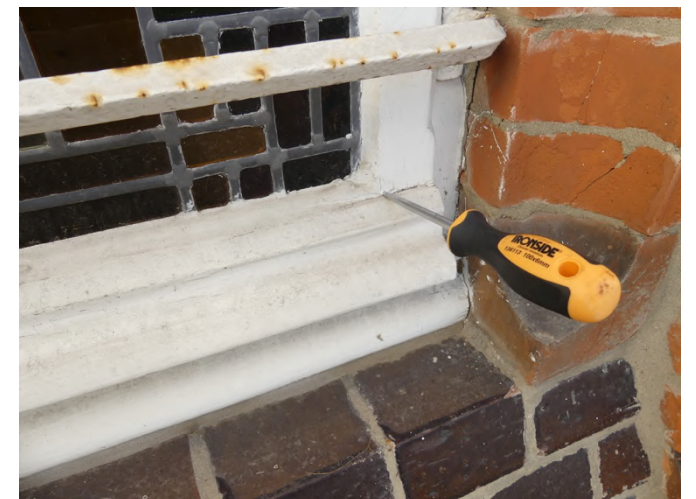
Afb. §30.06, gescheurde verf en verbinding
