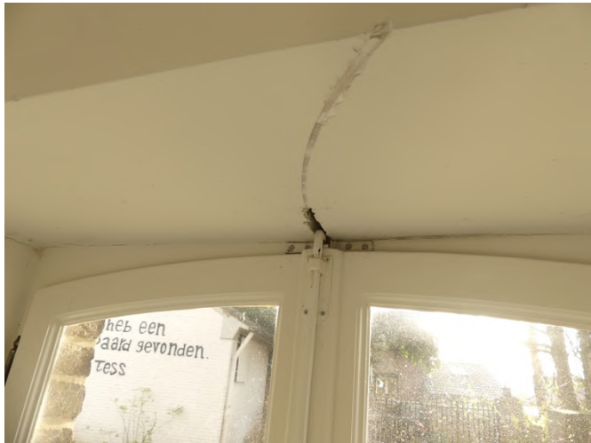
Afb. $40.07, mechanisch beschadigd stucwerk dagkant
