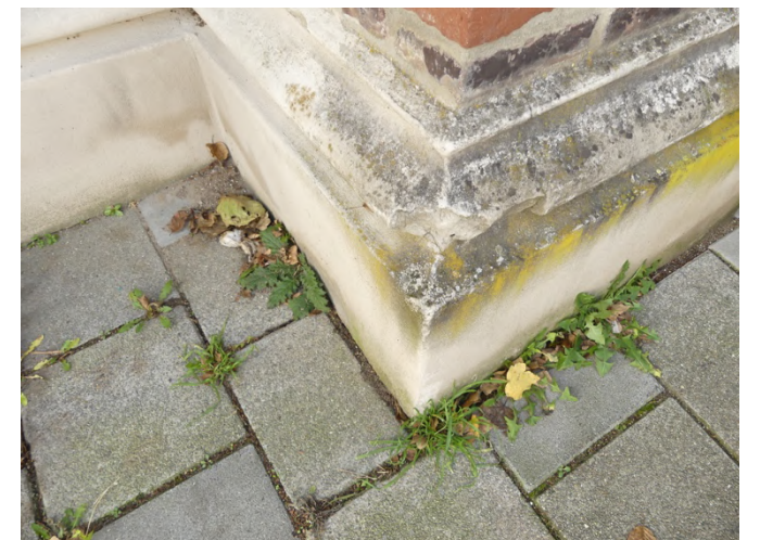
Afb. §40.04, afgebroken hoekje van vermoedelijk niet onder maaiveld doorgezet pleisterwerk (daardoor optrekkend vocht)
