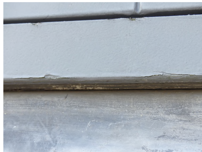
Afb. §46.21.12, op overgang voor-/onderzijde loslatende verf
