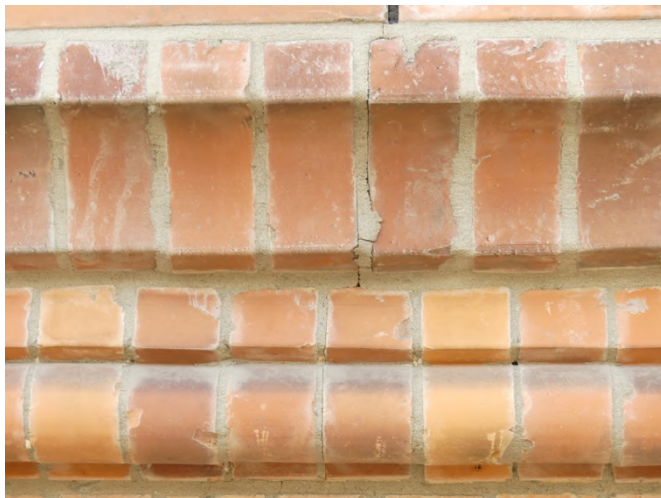
Afb. §22.03 gescheurde voeg tussen de uitgevallen stootvoegen
