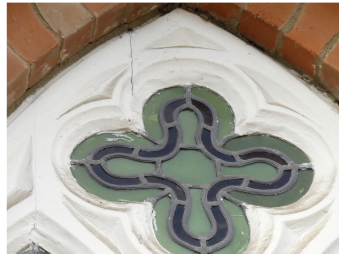
Afb. §30.03, gescheurde verbinding
