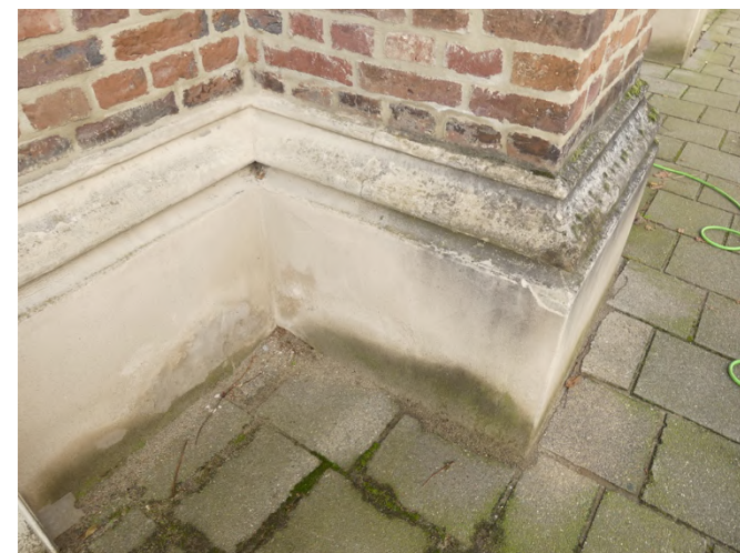
Afb. §40.03, vochtbelast, vervuild en beschadigd pleisterwerk
