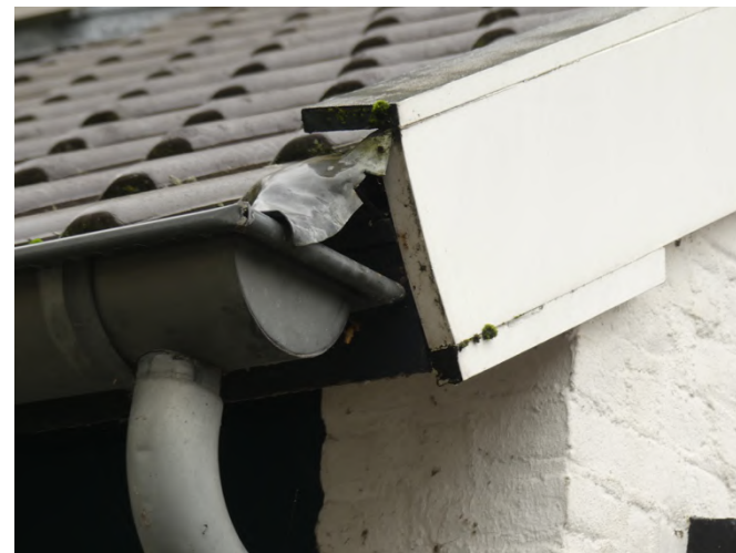
Afb. §50.01, slechte loodaansluiting
