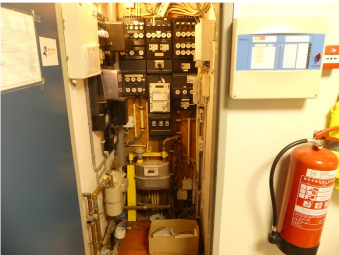
Afb. §89.06, meterkast met water op vloer
