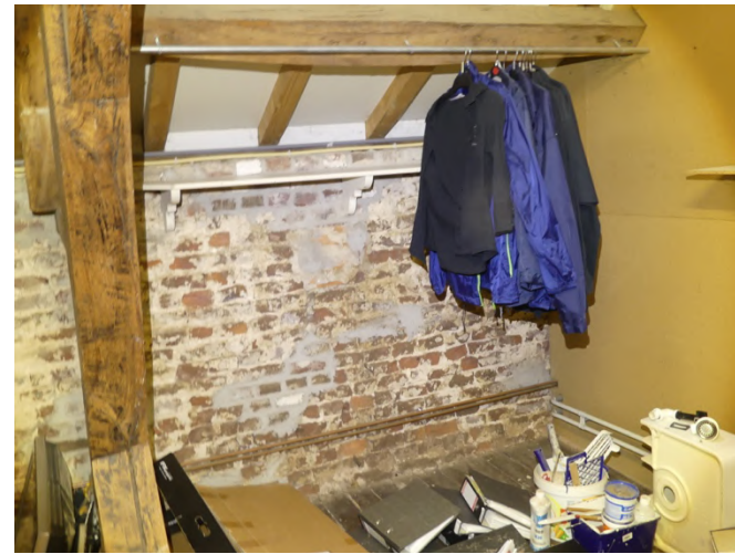
Afb. §22.05, oostelijke zolder, lichte scheurvorming in borstwering
