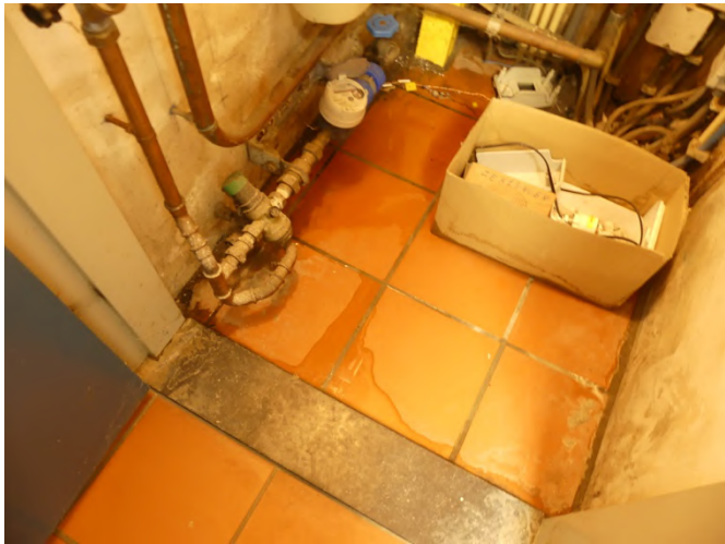
Afb. §89.07, water op vloer meterkast
