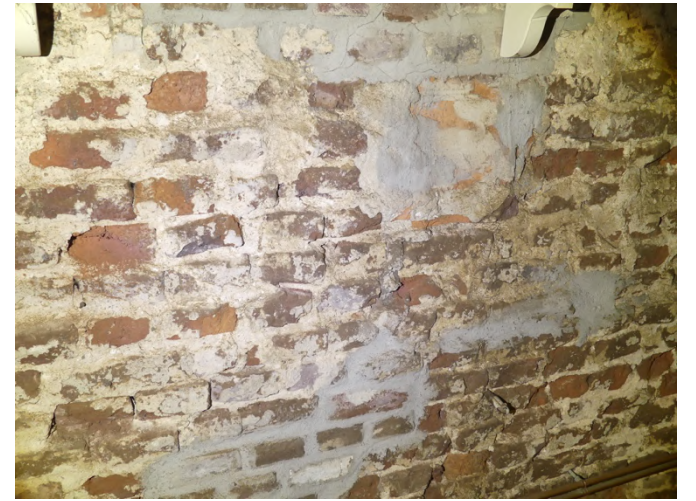
Afb. §22.06, slordige reparatie en afschilferende stenen
