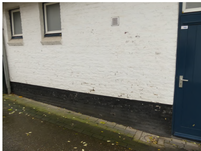
Afb. §46.22.12, beschadigd sauswerk
