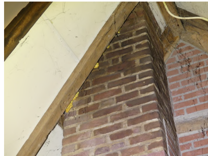
Afb. §22.09, roetdoorslag op binnenzijde schoorsteen
