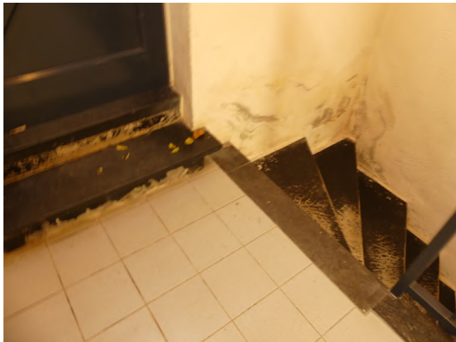
Afb. §22.13, vochtdoorslag bij westelijke trap naar souterrain
