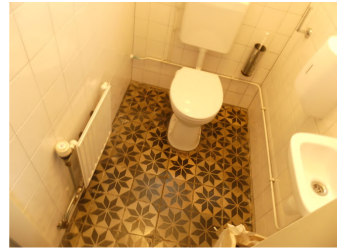
Afb. §41.04, gescheurd tegelvoegwerk en vloertegels
