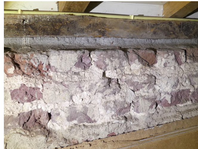
Afb. §22.07, afschilferende stenen, lichte scheurvorming en afgevalen kalklaag
