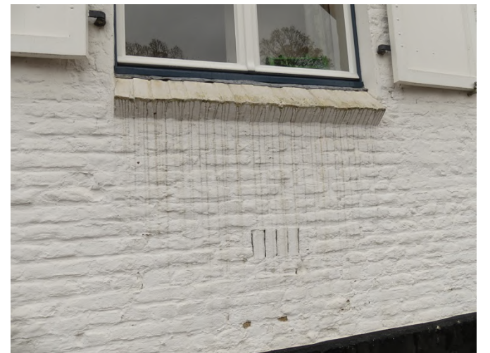
Afb. §46.22.03, vervuild sauswerk onder waterslag
