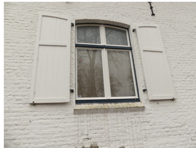
Afb. §46.22.03, vervuild sauswerk onder waterslag
