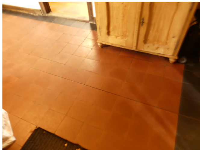
Afb. §41.02, onregelmatig liggende vloertegels
