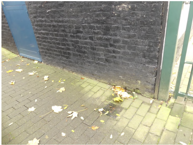
Afb. §22.11, uitgevallen voegwerk boven straatwerk
