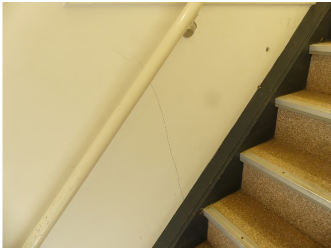
Afb. §40.01, gescheurd stucwerk
