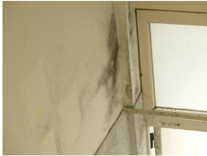
Afb. §22.12, vochtdoorslag aan binnenzijde entree naar westelijke zolder
