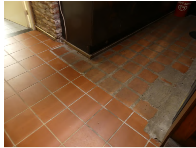
Afb. §41.03, door cementsluier beschadigde vloertegels
