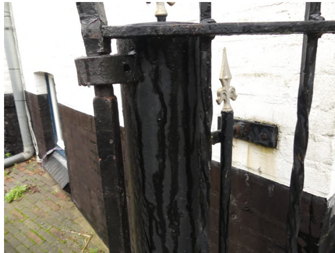
Afb. §46.22.02, barsten in verf, roestvorming op onderliggend ijzer
