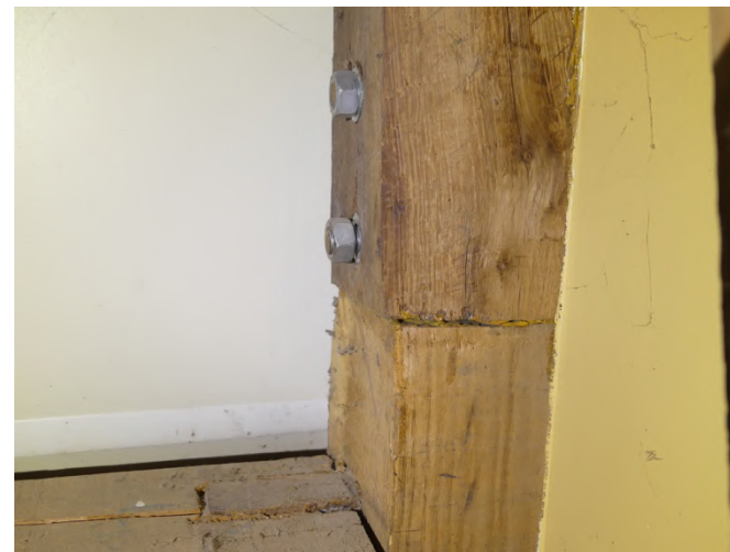
Afb. §24.03, verkeerd uitgevoerde verbinding
