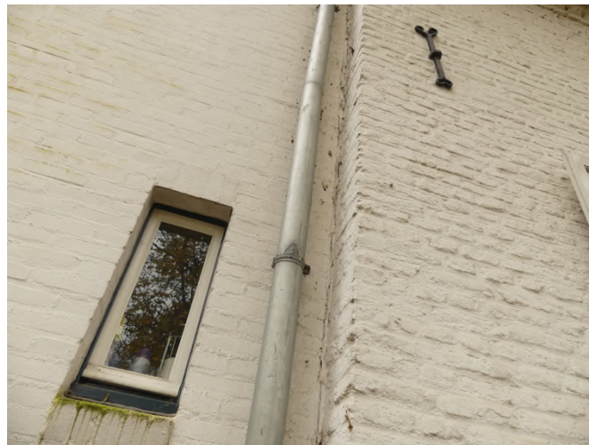
Afb. §46.22.10, beschadigd sauswerk rond hwa
