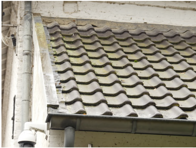
Afb. §33.07, slordig aangebracht en gapend loodwerk, onderste dakpannen liggen onregelmatig
