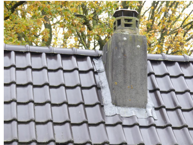
Afb. §33.03, slordig aangebrachte loodstroken aan schoorsteen
