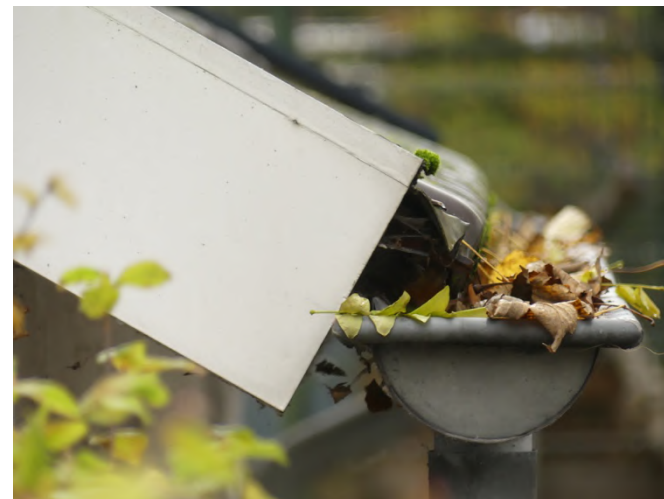
Afb. §50.03, met bladval overvolle dakgoot
