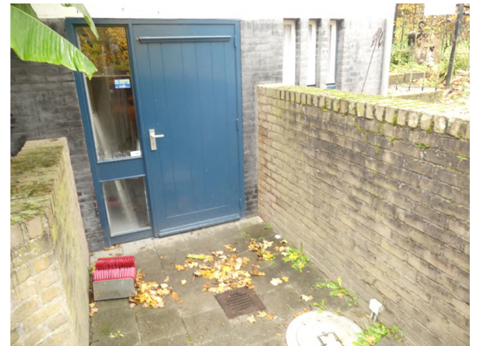
Afb. §22.10, mosgroei en hoge vochtbelasting op schansmuren
