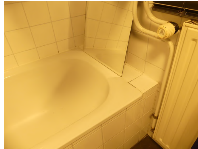
Afb. §41.05, gescheurd tegelvoegwerk
