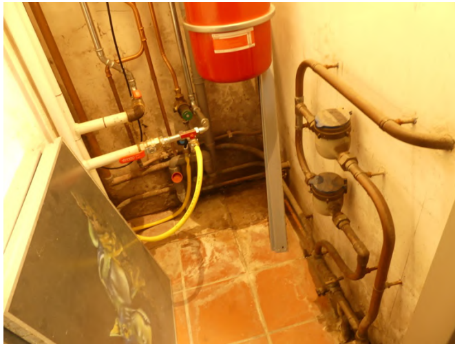
Afb. §89.05, cv-kast met oude lekkagesporen
