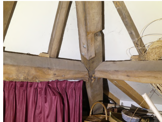
Afb. §24.01, foutief uitgevoerde haakse liplas, openstaande verbindingen
