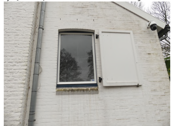
Afb. §46.22.06, vervuild sauswerk onder waterslag
