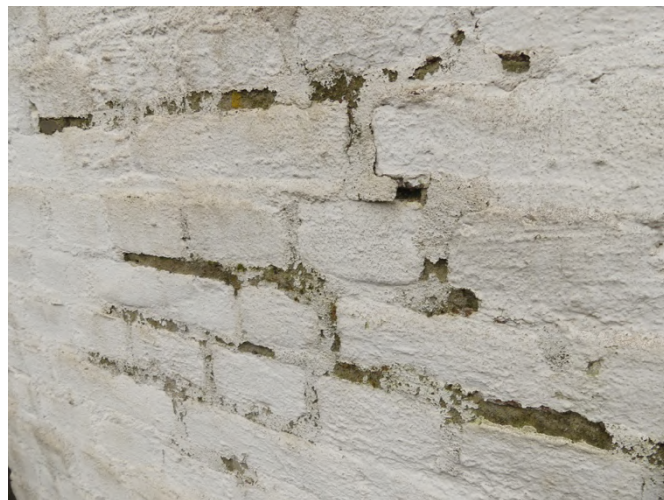
Afb. §22.04, van voegen loslatende verf
