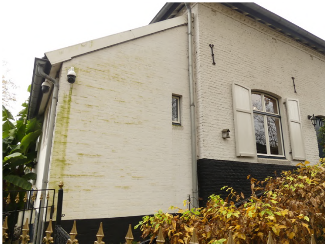
Afb. §46.22.09, algaanslag op sauswerk noordgevel
