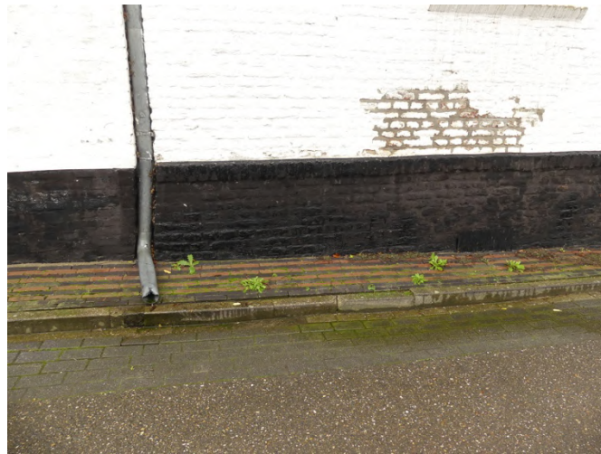
Afb. §22.02, slordig uitgevoerd en afgewerkt voegherstel en vervormde uitloop van de hemelwaterafvoer
