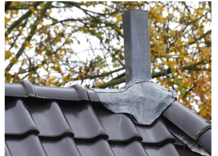
Afb. §33.04, onregelmatig liggende dakpan en slordig loodwerk bij piron
