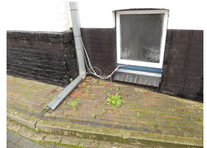
Afb. §50.02, vervormde uitloop hemelwaterafvoer
