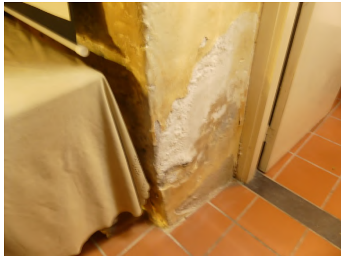
Afb. §40.02, door vocht- en/of zoutbelasting afgedrukt stucwerk
