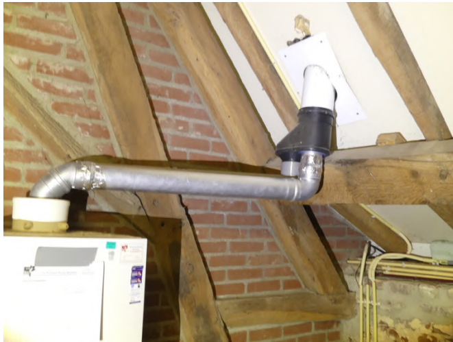
Afb. §89.03, slordig aangebrachte dakdoorvoer
