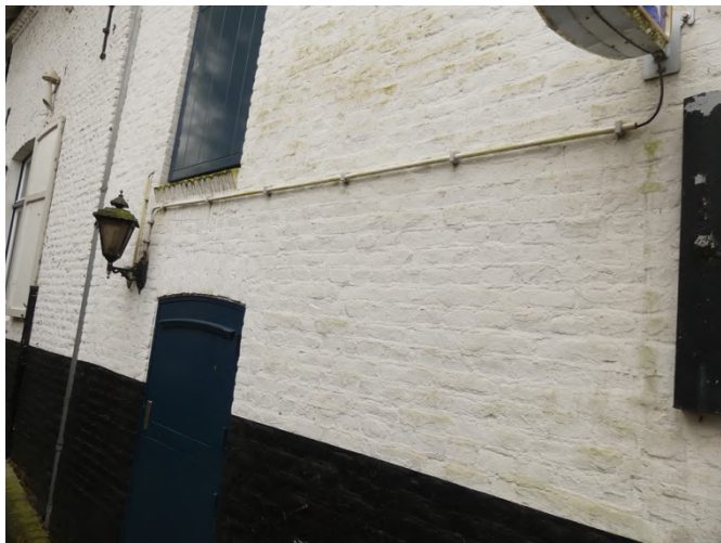
Afb. §46.22.11, lichte algaanslag en vervuiling noordgevel
