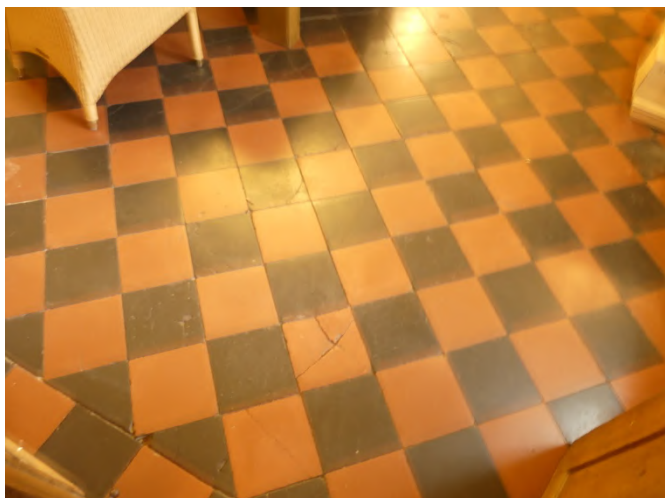
Afb. §41.01, gescheurde vloertegel
