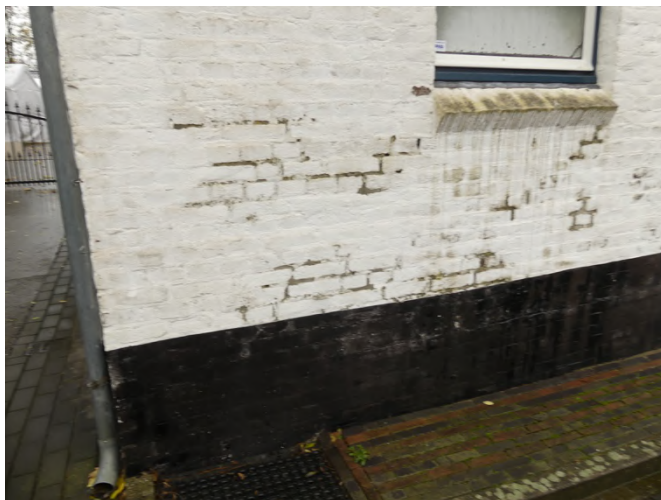
Afb. §22.03, vervuilde en loslatende verf, met name van de voegen, vermoedelijk door (hoge) vochtbelasting
