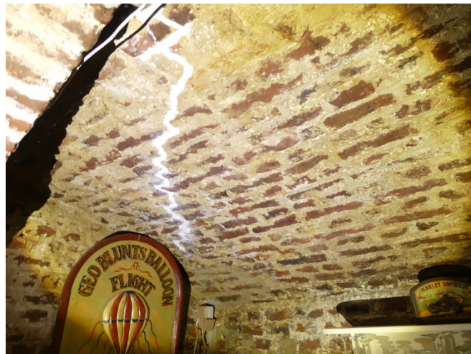
Afb. §22.16, met verkeerde kleur dichtgezette scheur in het gewelf
