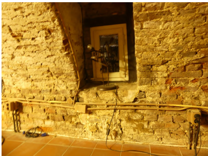
Afb. §22.15, afgefallen kalk-/slemplaag, loszittend en uitgevallen detonerende steen in de voegwerk, lichte scheurvorming
