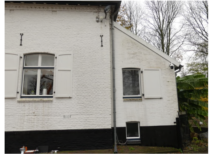
Afb. §46.22.02, vervuild sauswerk onder waterslagen
