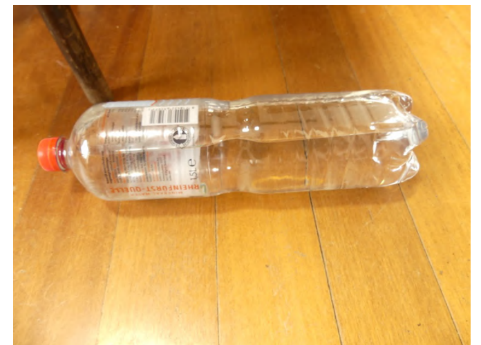
Afb. §24.06, scheef liggende vloer
