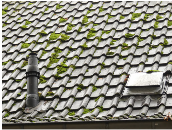
Afb. §33.08, mosgroei op het dak
