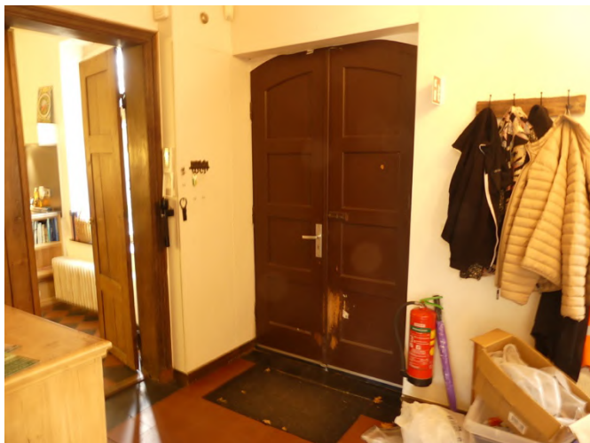
Afb. §46.22.03, beschadigde verf op toegangsdeur
