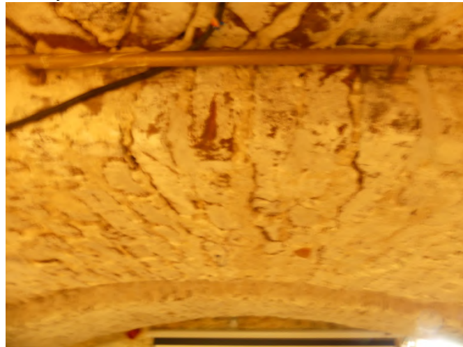
Afb. §22.14, gescheurd metselwerk in gewelven
