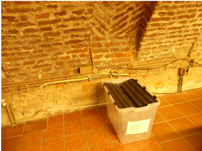
Afb. §89.08, leidingwerk op de muur van souterrain
