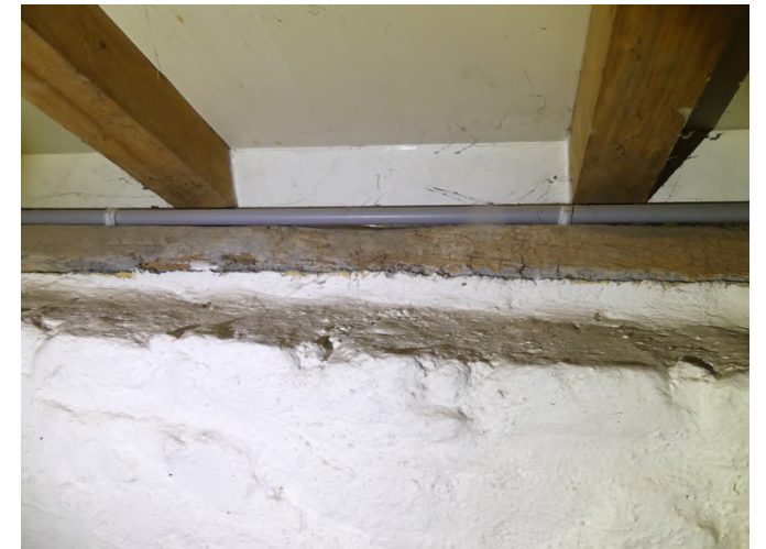
Afb §24.02, (oude?) bruinrotaantasting in de muurplaat
