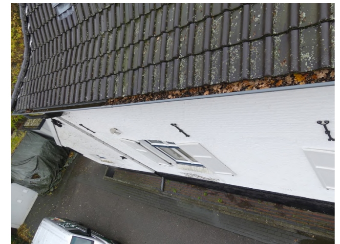
Afb. §50.04, veel bladval in dakgoot, afschot lijkt verkeerd
