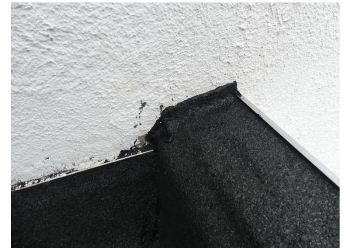
Afb. §33.10, opstand tegen opgaande muur niet ingewerkt
