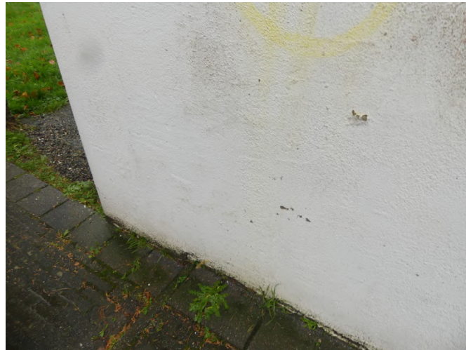
Afb. §46.21.10, volledig scheurende verf onderzijde lijstwerk
