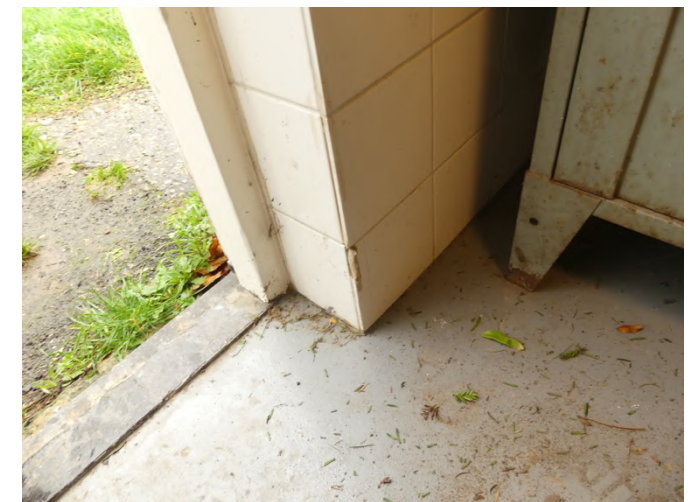
Afb. §41.05, mechanische beschadiging
