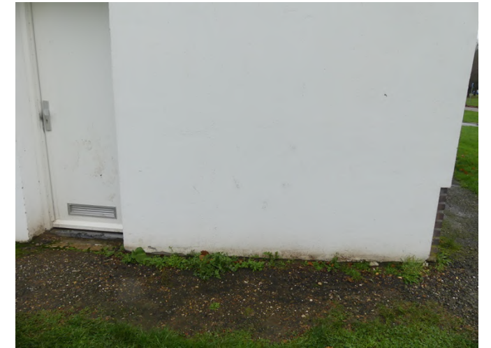
Afb. §40.08, door opspattend regenwater vervuild pleisterwerk, niet onder maaiveld doorgezet
