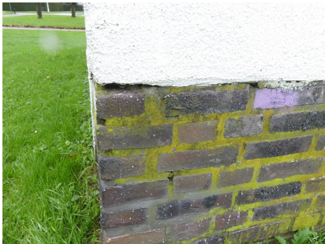
Afb. §22.07, alggroei en slordig afgewerkt pleisterwerk
