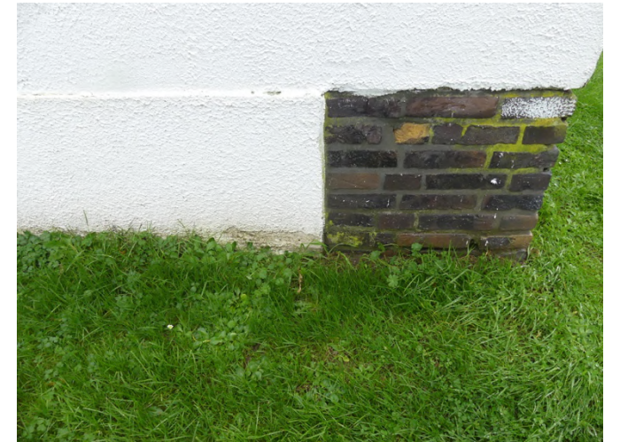
Afb. §46.22.16, slordig uitgevoerd sauswerk
