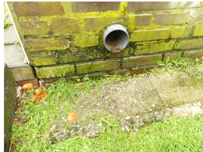
Afb. §22.01, alggroei en uitgespoeld voegwerk bij maaiveld
