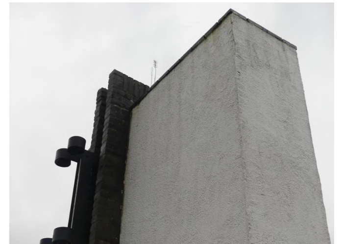
Afb. §22.14, begroeiing op afdekken toren, vervuild pleisterwerk
