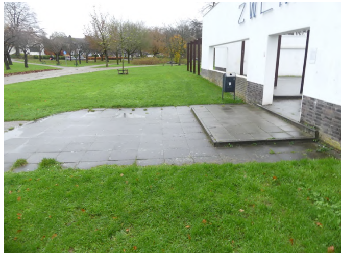
Afb. §15.01, begroeid, verzakkend tegelwerk met plasvorming
