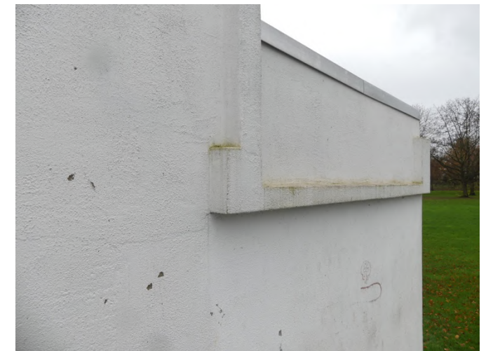
Afb. §40.10, alggroei en vervuiling op liggend pleisterwerk
