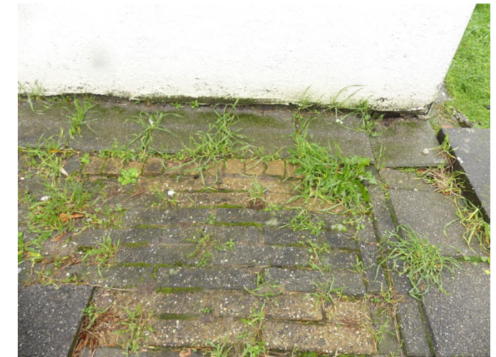
Afb. §15.08, begroeid, verzakkend tegelwerk, valgevaar
