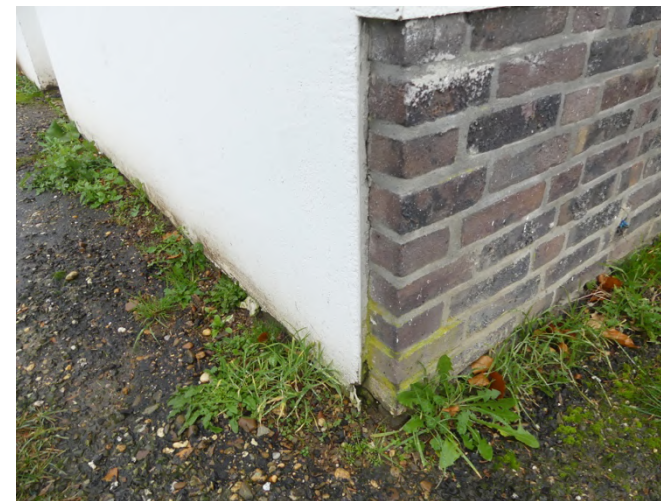
Afb. §40.09, niet onder maaiveld doorgezet pleisterwerk
