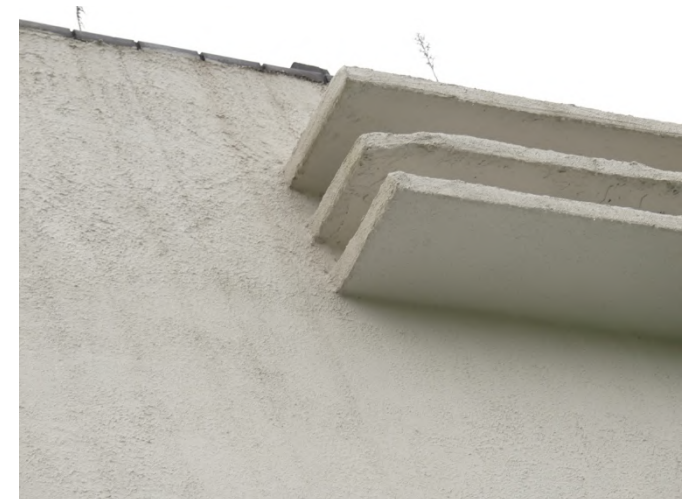
Afb. §40.22, mechanisch beschadiging
