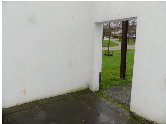
Afb. §15.04, begroeid, verzakkend tegelwerk met plasvorming
