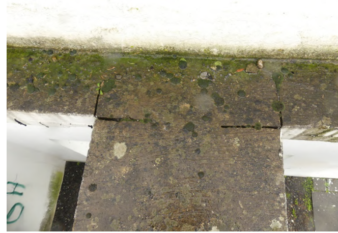
Afb. §21.07, zaagsnedes en scheurvorming de wapening
