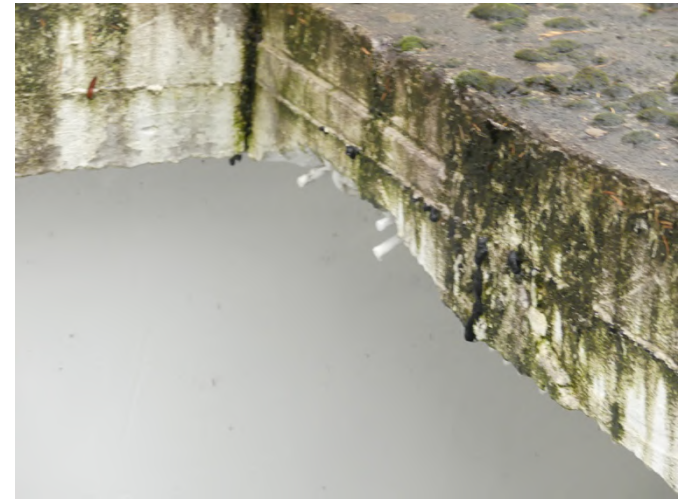
Afb. §21.08, afboerend beton door te weinig betondekking op
