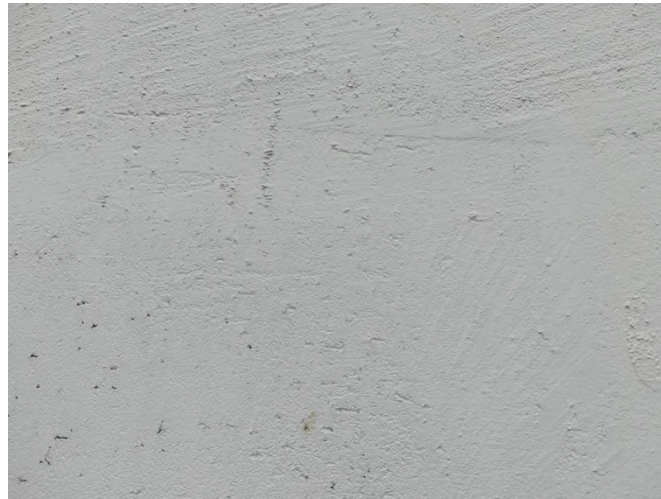
Afb. §40.04, slordig, onregelmatig afgewerkt pleisterwerk
