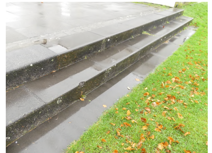
Afb. §15.06, beschadigde traptreden
