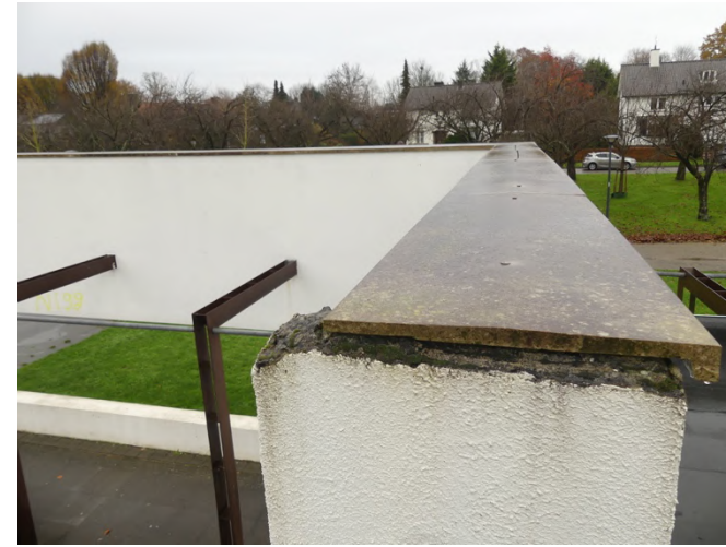
Afb. §35.01, overzicht natuursteen afdekken, zeer slordig aangewerkt
