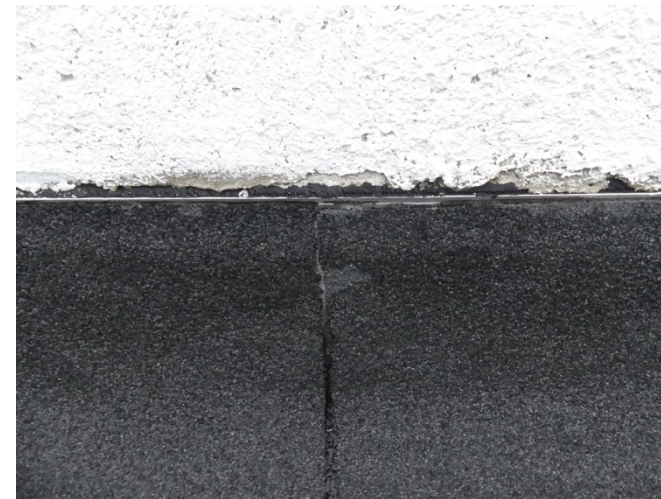
Afb. §33.09, opstand tegen opgaande muur niet ingewerkt
