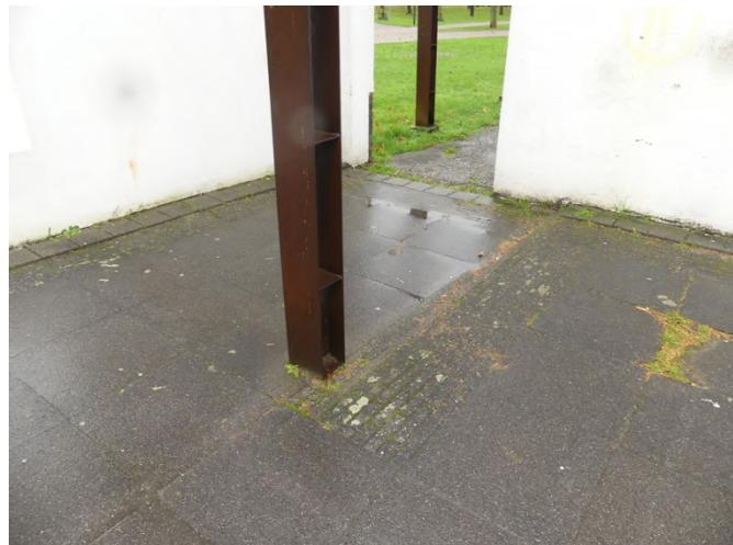
Afb. §15.03, begroeid, verzakkend tegelwerk met plasvorming
