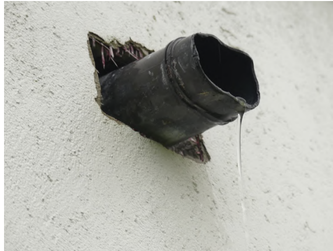
Afb. §40.02, zeer slordig -nauwelijks!- afgewerkte doorvoer
