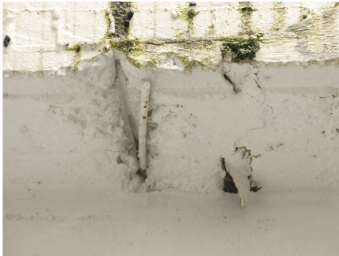
Afb. §21.03, te weinig betondekking
