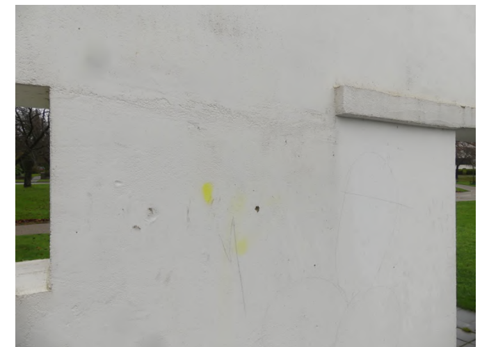
Afb. §40.12, graffiti, mechanische beschadigingen, onregelmatig afgewerkt pleisterwerk
