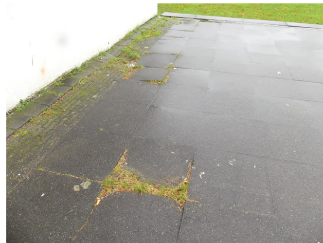
Afb. §15.09, begroeid, verzakkend tegelwerk, valgevaar publiek
