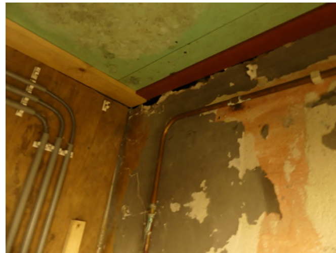
Afb. §40.30, beschadigd, losgelaten pleisterwerk
