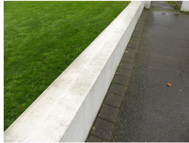
Afb. §46.22.13, vervuild en losscheurend liggend sauswerk
