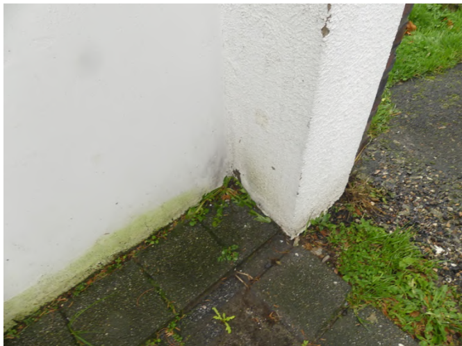
Afb. §46.22.11, door optrekkend vocht afbladderend sauswerk,
