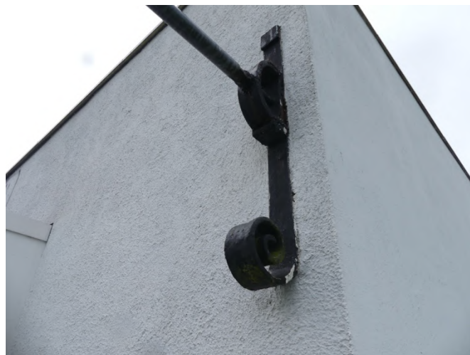
Afb. §40.06, te dik opgezet pleisterwerk, smeedijzeren element volledig opgenomen in pleisterlaag
