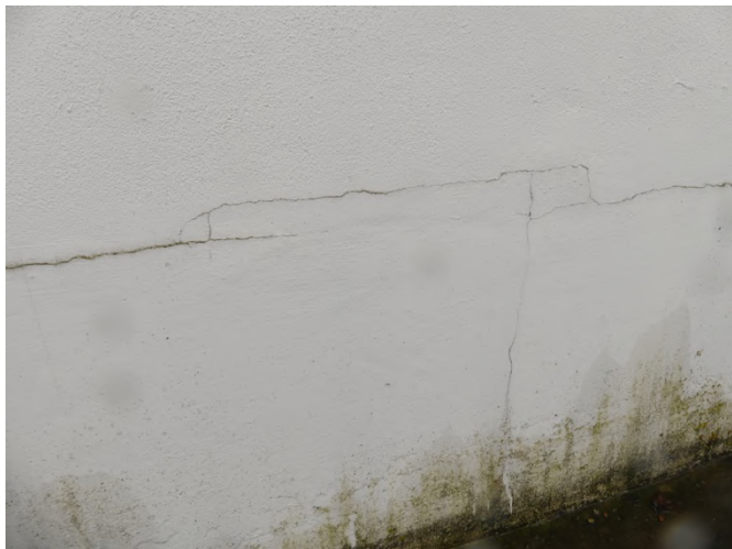
Afb. §40.17, forse, waarschijnlijk bouwkundige, scheuren en vervuild pleisterwerk
