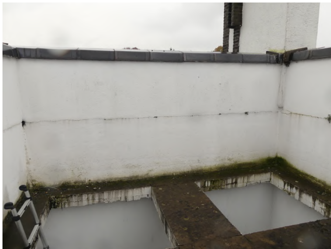
Afb. §40.15, horizontaal gescheurd en vervuild pleisterwerk
