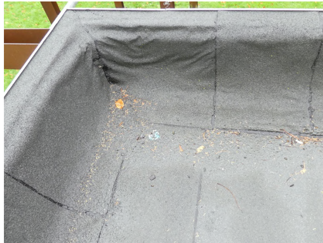
Afb. §33.06, onregelmatige ondergrond van de dakrand en loslatende en uitzakkende dakbedekking in de hoek
