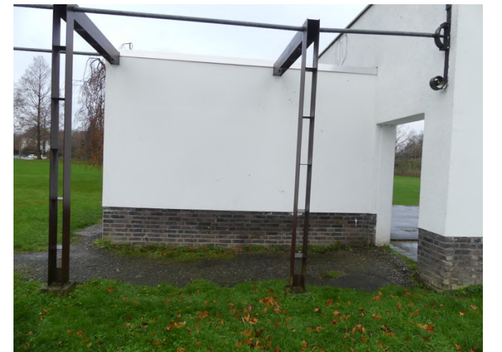
Afb. §22.04, alggroei en uitgespoeld voegwerk bij maaiveld
