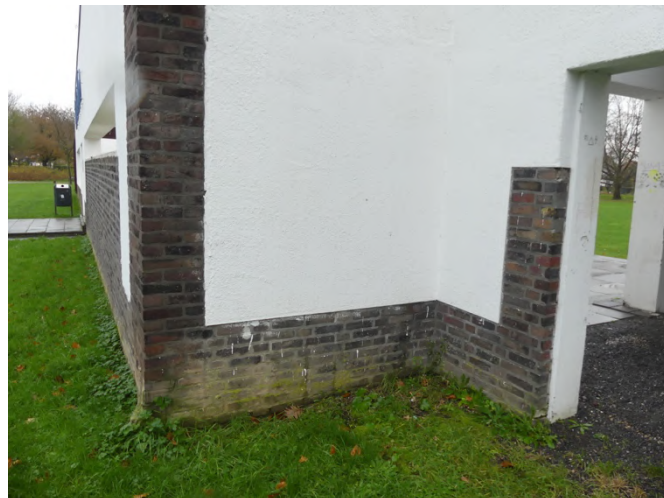
Afb. §22.10, alggroei en uitgespoeld voegwerk bij maaiveld
