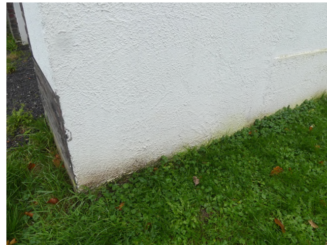
Afb. §46.22.17, mechanische beschadiging en optrekkende vervuiling
