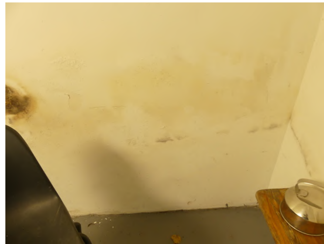
Afb. §40.26, zwaar vervuild pleisterwerk en aftekening vochtbelasting
