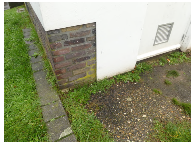
Afb. §22.03, alggroei en uitgespoeld voegwerk bij maaiveld
