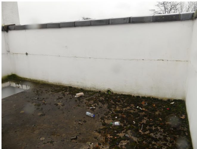
Afb. §40.16, horizontaal gescheurd en vervuild pleisterwerk
