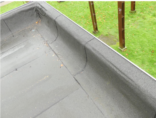
Afb. §33.05, onregelmatige ondergrond van de dakrand en loslatende en uitzakkende dakbedekking in de hoek
