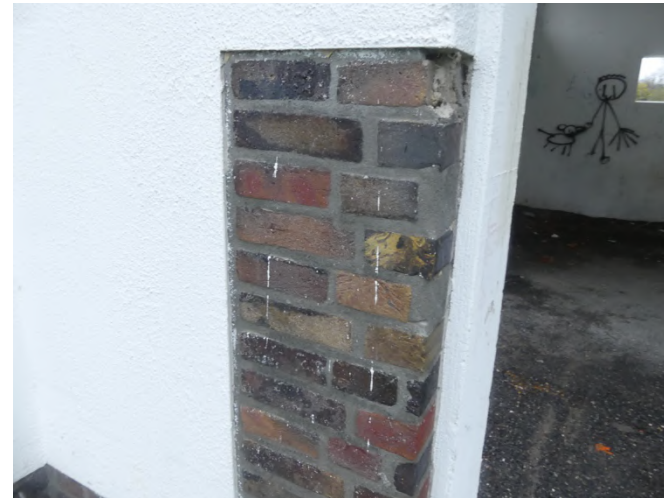
Afb. §22.11, beschadigd/slecht hersteld metselwerk
