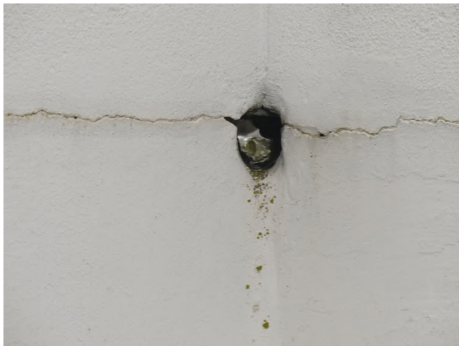
Afb. §40.18, horizontale scheur en gat in muur
