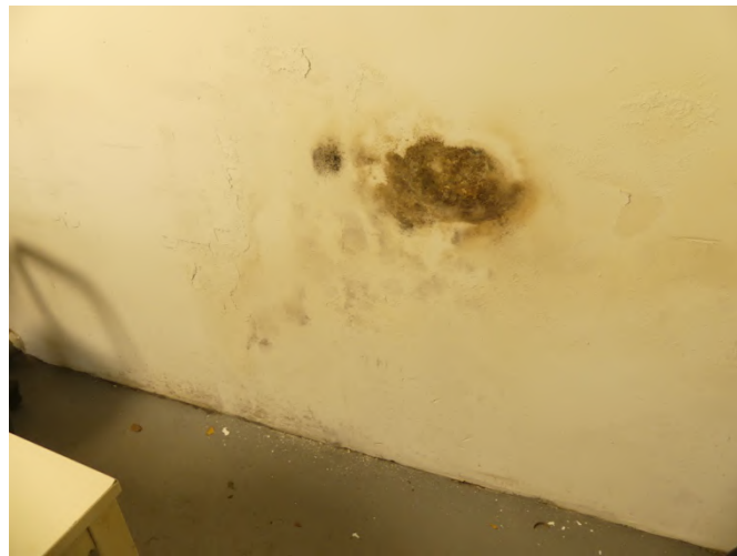
Afb. §40.25, zwaar vervuild pleisterwerk
