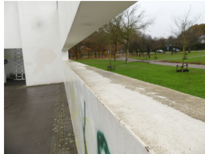
Afb. §46.22.15, vervuild en losscheurend liggend sauswerk en graffiti
