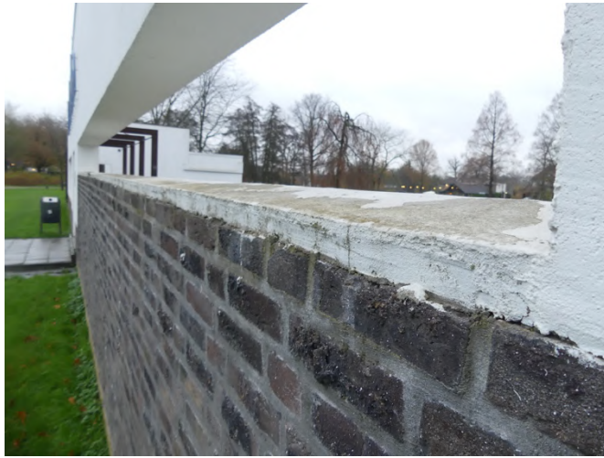
Afb. §40.14, zeer slordig onafgewerkte aansluiting pleisterwerk op metselwerk
