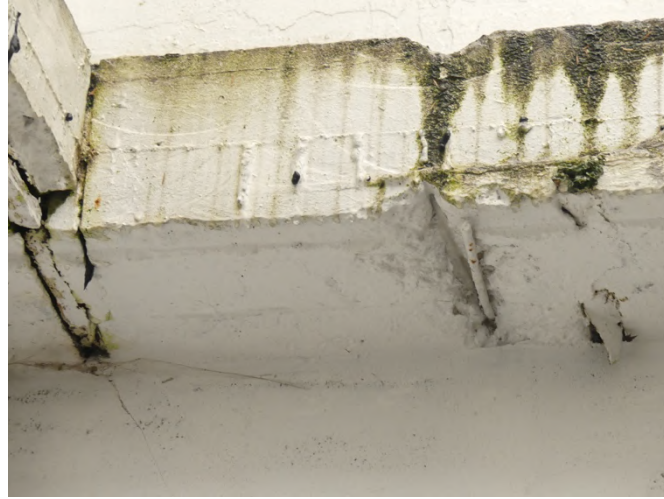
Afb. §21.02, scheurvorming en zaagsnede
