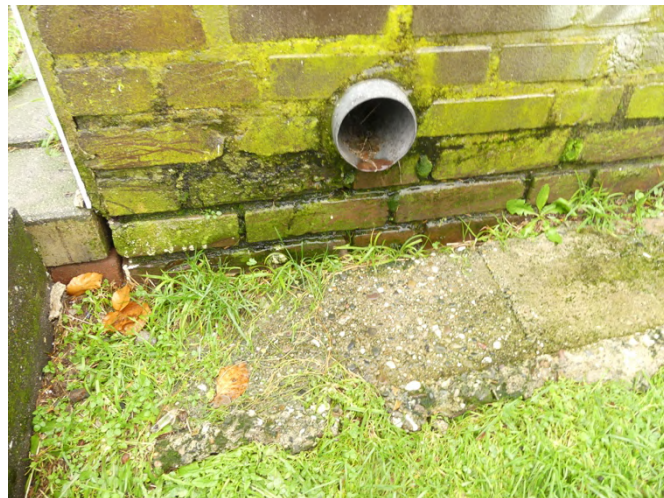
Afb. §52.04, geveldoorvoer, onbekend waarvoor
