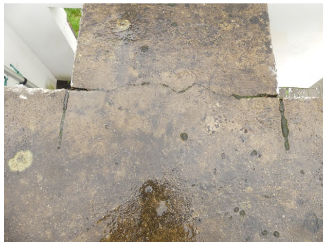
Afb. §21.06, zaagsnedes en scheurvorming
