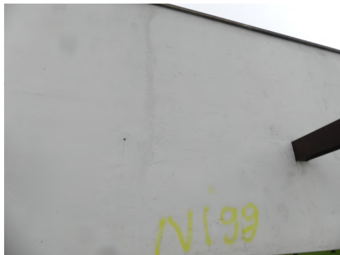
Afb. §46.22.12, graffiti en vuilsporen door afgebroken natuursteen afdekker
