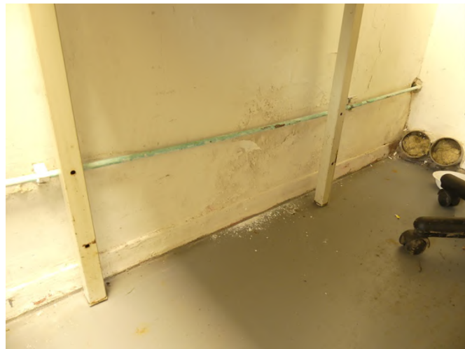
Afb. §40.27, beschadigd, vochtbelast pleisterwerk
