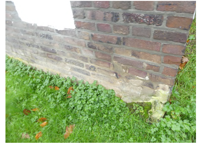
Afb. §22.12, beschadigd metselwerk
