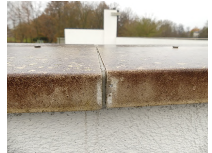
Afb. §35.04, van bovenzijde aangebrachte schroeven, risico op lekkage
