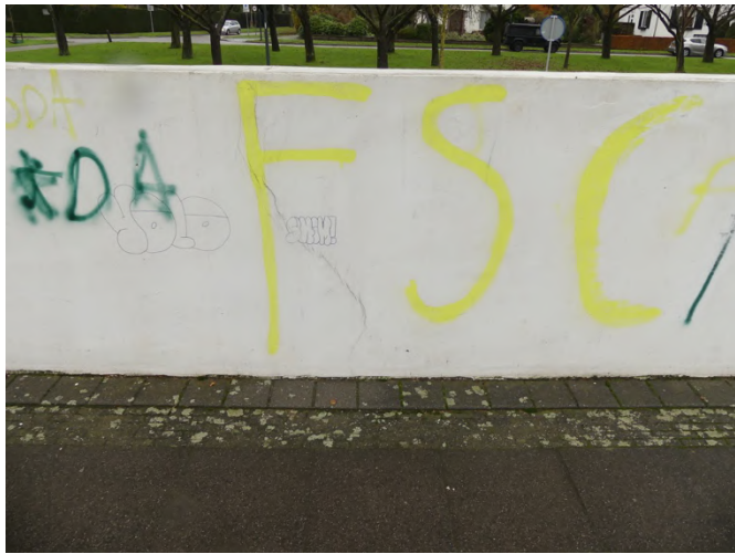
Afb. §40.13, graffiti, gescheurd pleisterwerk, niet onder maaiveld doorgezet pleisterwerk
