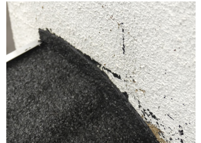
Afb. §33.12, opstand tegen opgaande muur niet ingewerkt
