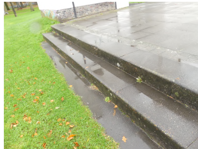
Afb. §15.07, enigszins verzakte, beschadigde traptreden en verzakt tegelwerk aansluitend terras
