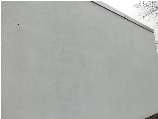
Afb. §40.03, slordig, onregelmatig afgewerkt pleisterwerk
