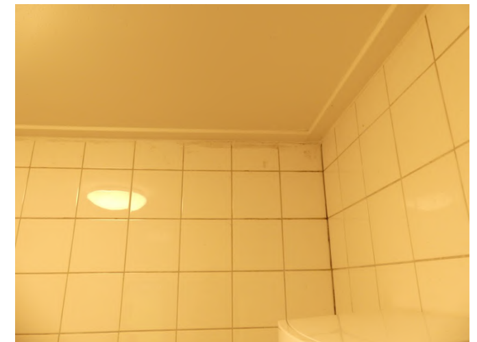
Afb. §41.02, gescheurde hoek en verontreinigde rand (onder plafondplint)
