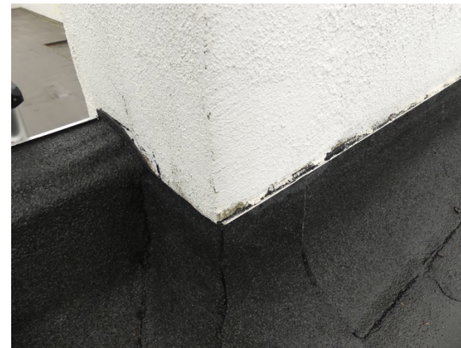
Afb. §33.11, opstand tegen opgaande muur niet ingewerkt
