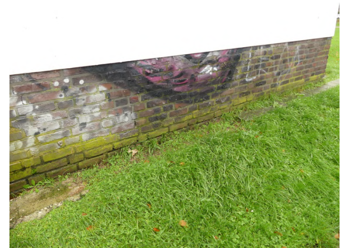
Afb. §22.02, alggroei en uitgespoeld voegwerk bij maaiveld
