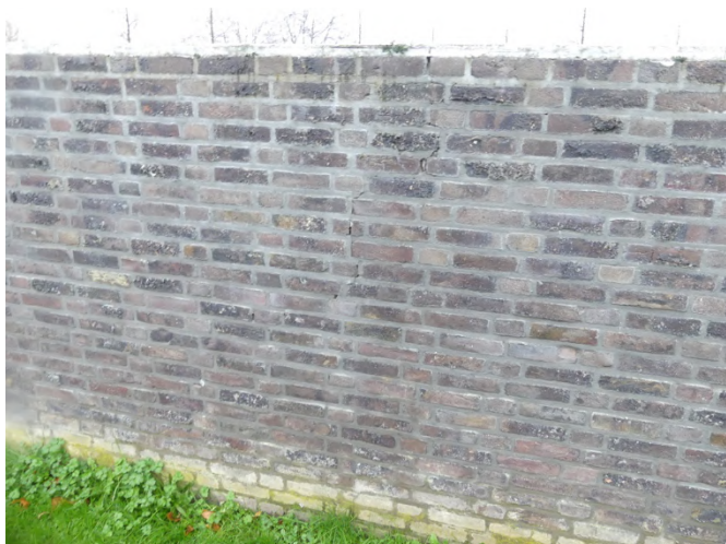
Afb. §22.09, uitgespoeld voegwerk bij maaiveld
