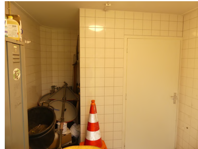
Afb. §41.01, overzicht betegelde ruimte, gescheurde hoek
