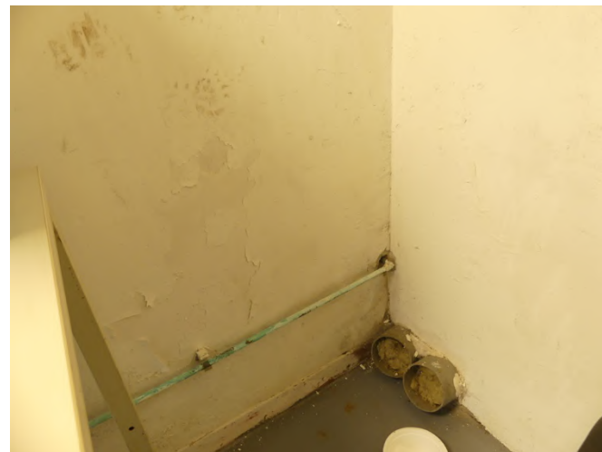
Afb. §40.28, beschadigd, vochtbelast pleisterwerk
