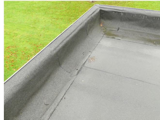
Afb. §33.07, onregelmatige ondergrond van de dakrand en loslatende en uitzakkende dakbedekking bij de mastiek
