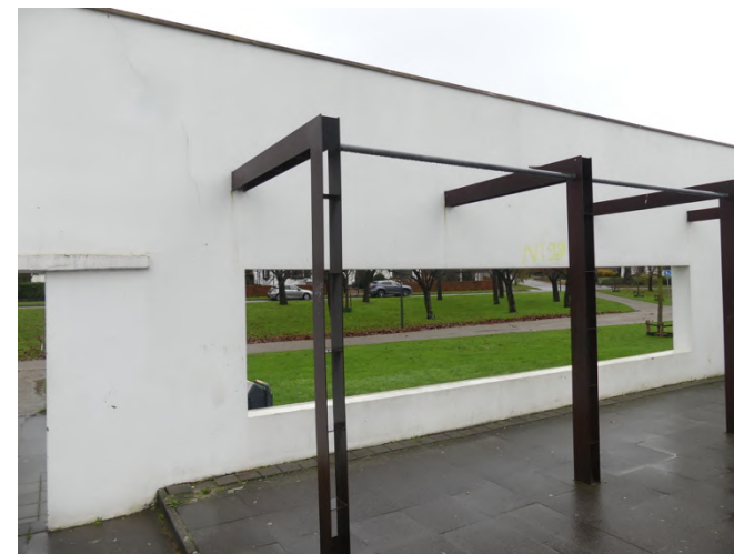
Afb. §40.11, graffiti, roestsporen, gescheurd pleisterwerk
