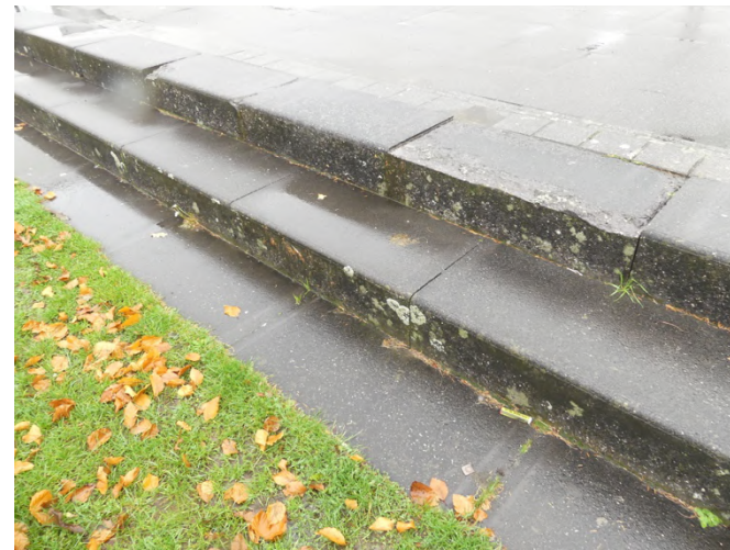
Afb. §15.05, enigszins verzakte, beschadigde traptreden
