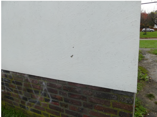
Afb. §46.22.09, volledig scheurende verf onderzijde lijstwerk
