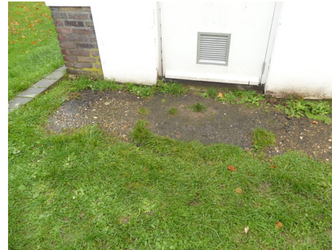
Afb. §40.07, door opspattend regenwater vervuild pleisterwerk, niet onder maaiveld doorgezet
