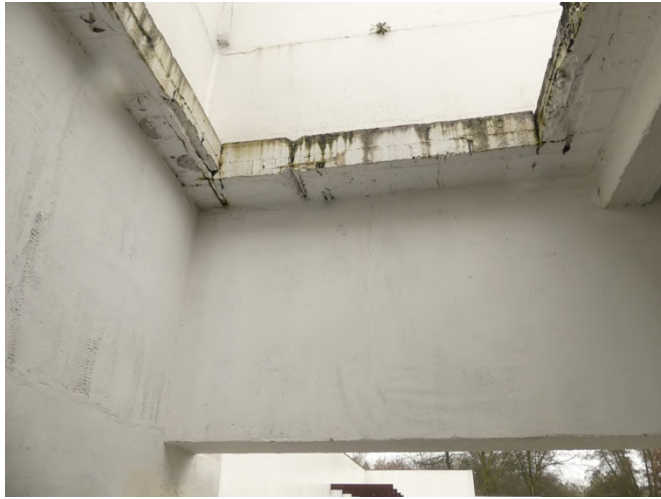
Afb. §21.01, ondeskundig ingezaagde sparing
