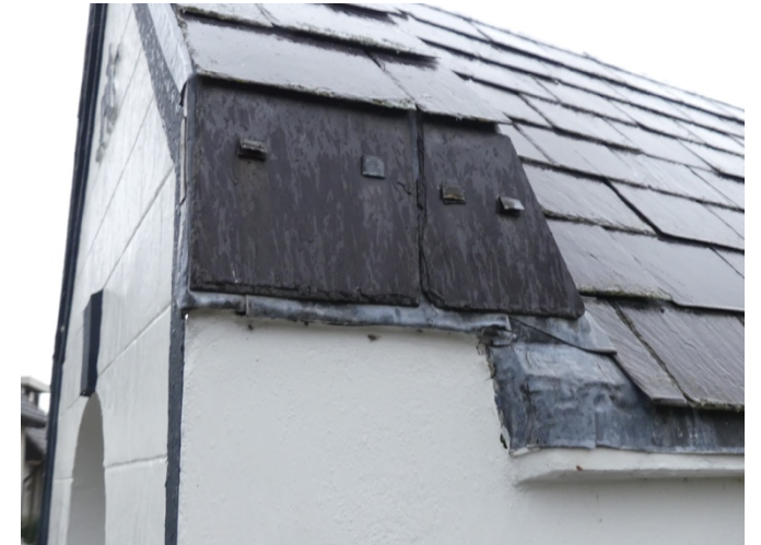
Afb. §33.08, trotseerloodjes opgewaaid, koeverleien (?) te kort (gapende opening met liggende leien)
