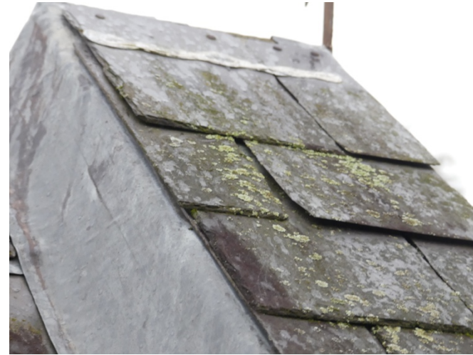
Afb. §33.05, zeer dun versleten en gapende leien op de topgevel, de bovenste met nagels zonder trotseerloodje bevestigd, noklood verdwenen (oude kitresten)
