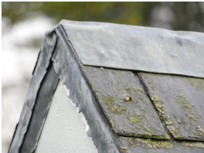
Afb. §33.03, noklood zonder deugdelijk einddetail aangebracht
