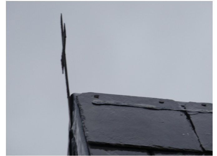
Afb. §33.06, zeer dun versleten leien op de topgevel, de bovenste met nagels zonder trotseerloodje bevestigd, noklood verdwenen (oude kitresten), nagels komen los
