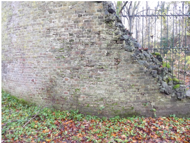
Afb. §22.21, loszittend en uitgevallen voegwerk, kapotte stenen
