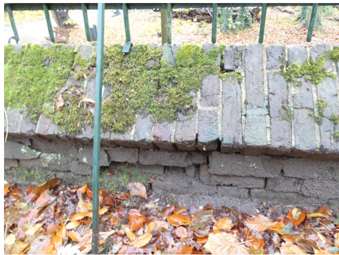
Afb. §22.07, gescheurd metselwerk
