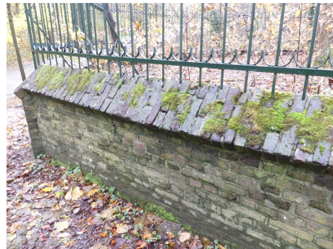
Afb. §22.15, mosgroei en uitgespoeld voegwerk
