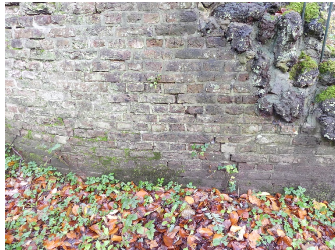
Afb. §22.22, loszittend, uitgevallen voegwerk
