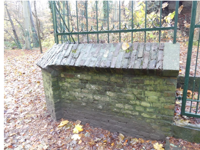
Afb. §22.01, algaanslag en vervuiling door opspattend druiwater, uitgespoeld en loszittend voegwerk
