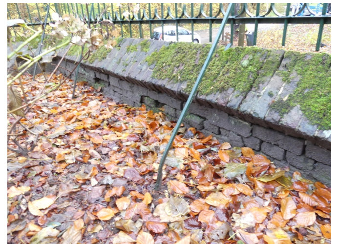
Afb. §22.04, mosgroei, uitgespoeld en uitgevallen voegwerk, uitgevallen stenen, afgefallen pleisterwerk, scheur in ezelsrug
