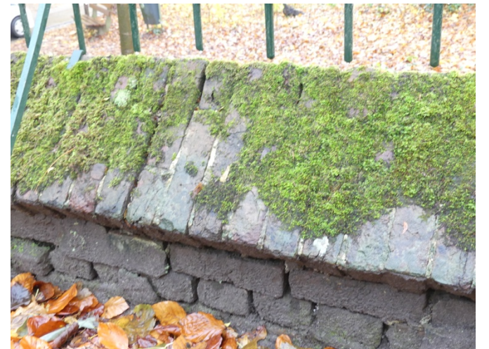
Afb. §22.06, mosgroei, afgefallen pleisterwerk en loszittende stenen
