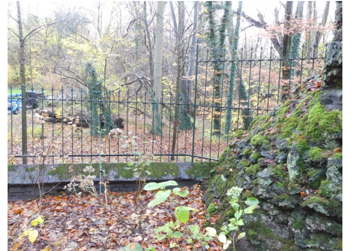
Afb. §22.02, mosgroei op ezelsrug, uitgespoeld voegwerk
