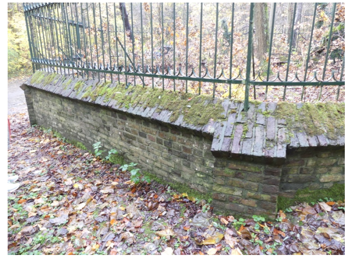
Afb. §22.14, mosgroei, uitgespoeld voegwerk en slordig (hersteld ?) metselwerk
