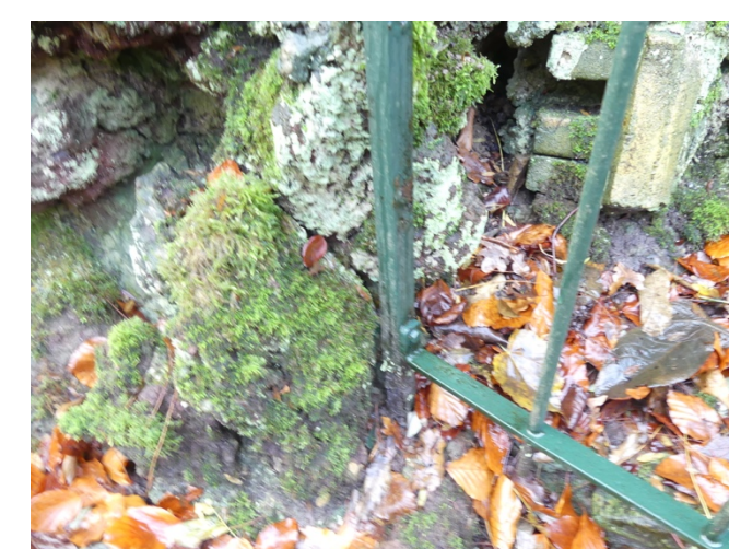
Afb. §43.20, roestvorming op staander, zeskantbouten als bevestiging op pilaster
