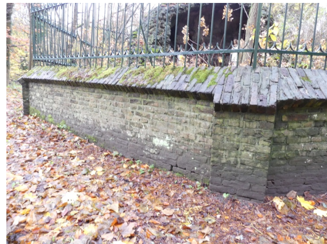
Afb. §22.17, uitgespoeld, uitgevallen voegwerk bij maaiveld
