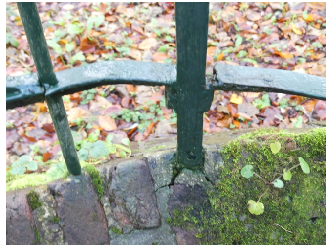
Afb. §43.05, gescheurde onderregel en slechte reparatie
