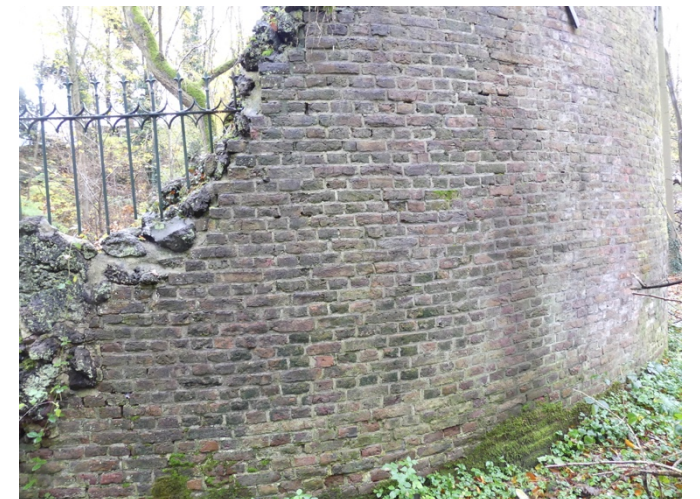
Afb. §22.30, lekkagespoor, loszittend en uitgevallen voegwerk en kapotte stenen
