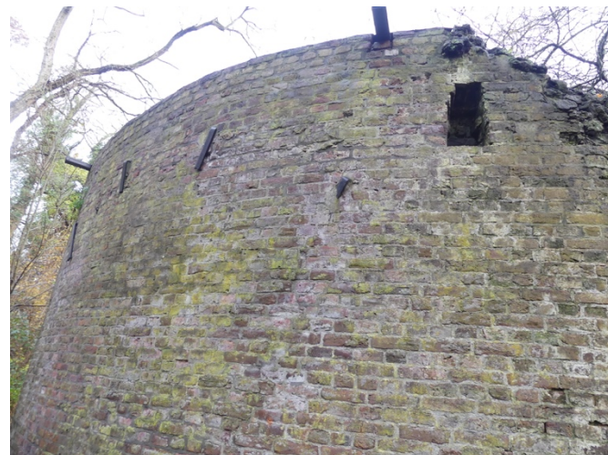
Afb. §22.24, uitgevallen voegwerk, gat in metselwerk
