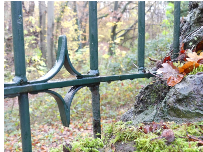
Afb. §43.07, slordige reparaties en roestvorming
