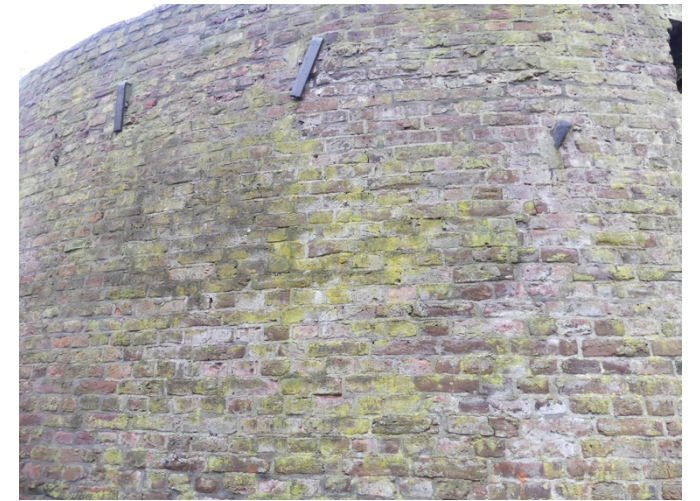
Afb. §22.26, uitgespoeld en uitgevallen voegwerk, kapotte stenen
