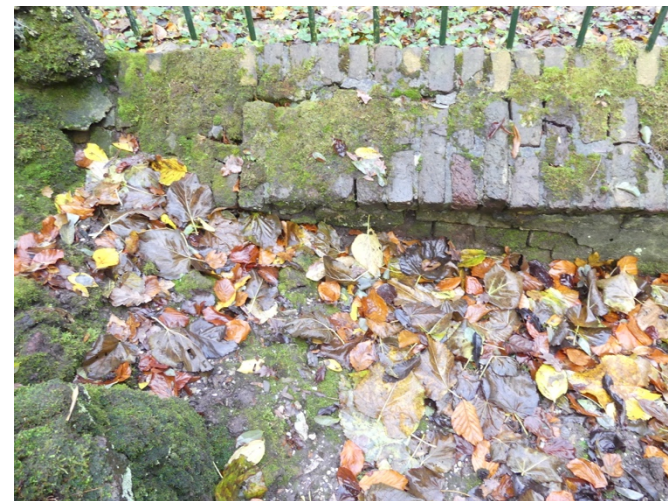
Afb. §22.10, gescheurde ezelsrug, loszittend werk onder de ezelsrug (voegwerk, pleisterwerk, stenen)
