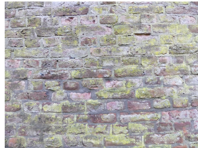
Afb. §22.29, slordig hersteld en weer uitgevallen voegwerk
