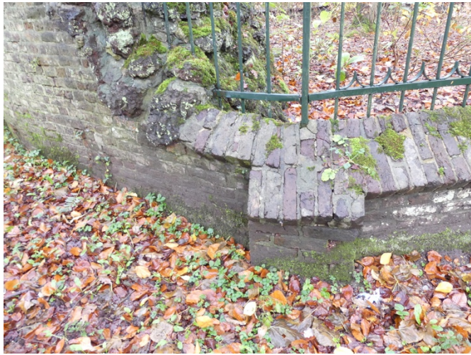
Afb. §22.19, beschadigde ezelsrug, slordig hersteld voegwerk
