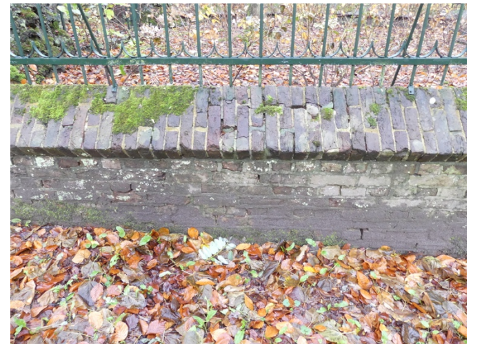
Afb. §22.18, mosgroei, uitgespoeld voegwerk, gescheurde ezelsrug, kapotte stenen
