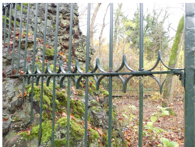
Afb. §43.14, slechte reparaties en roestvorming
