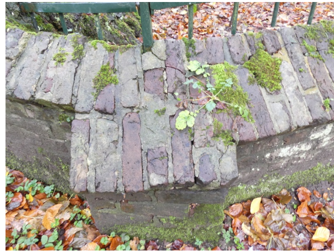
Afb. §22.20, losgescheurde mortel rondom hekspijl (roest?)
