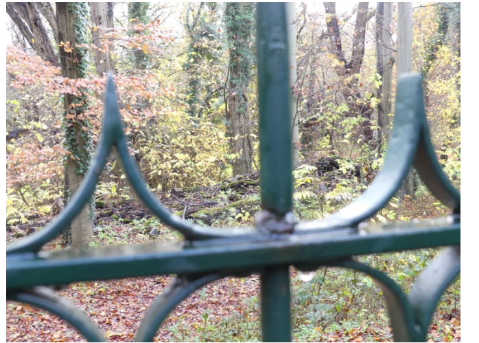
Afb. §43.08, slordige reparatie
