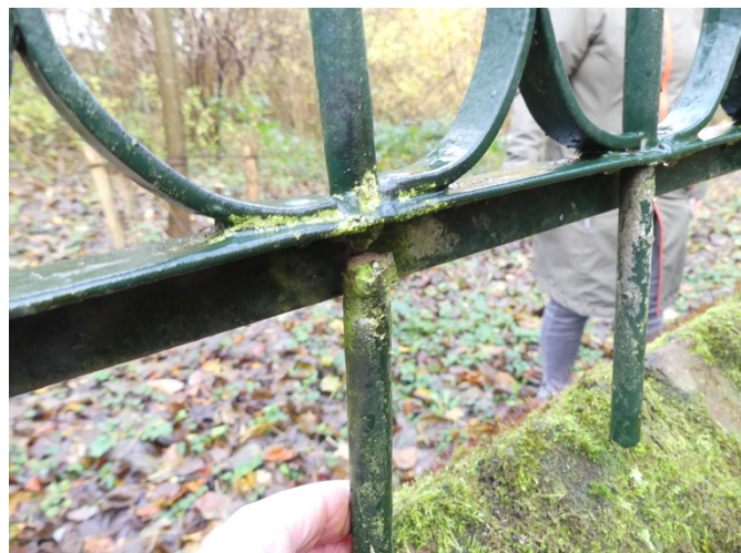
Afb. §43.11, afgebroken bevestiging baluster en roestvorming
