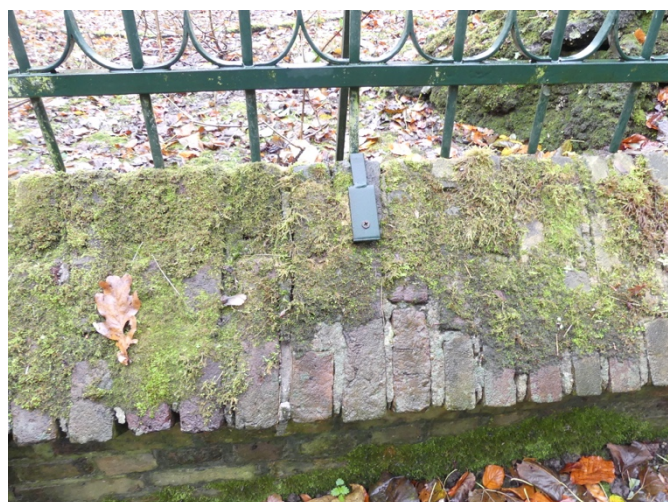
Afb. §43.13, volkomen afwijkende bevestiging met roestende kruiskopmoer
