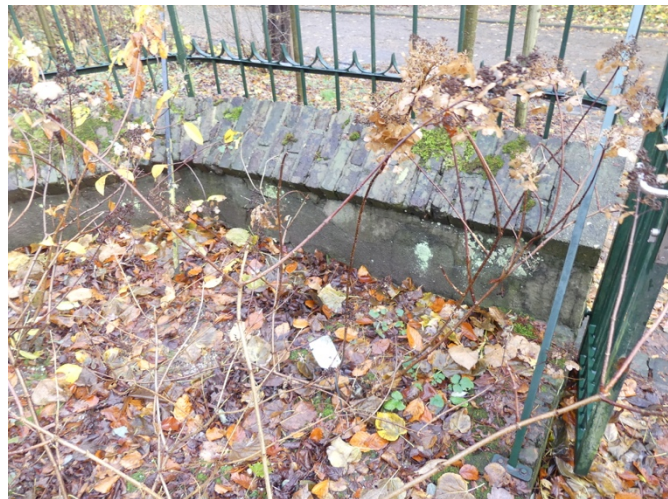
Afb. §22.12, uitgespoeld, losgekrompen voegwerk, barsten in pleisterwerk
