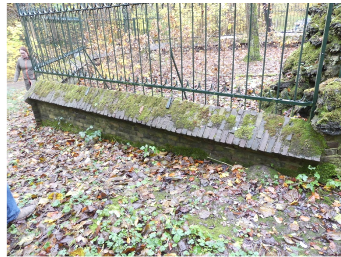
Afb. §22.13, mosgroei en uitgespoeld voegwerk
