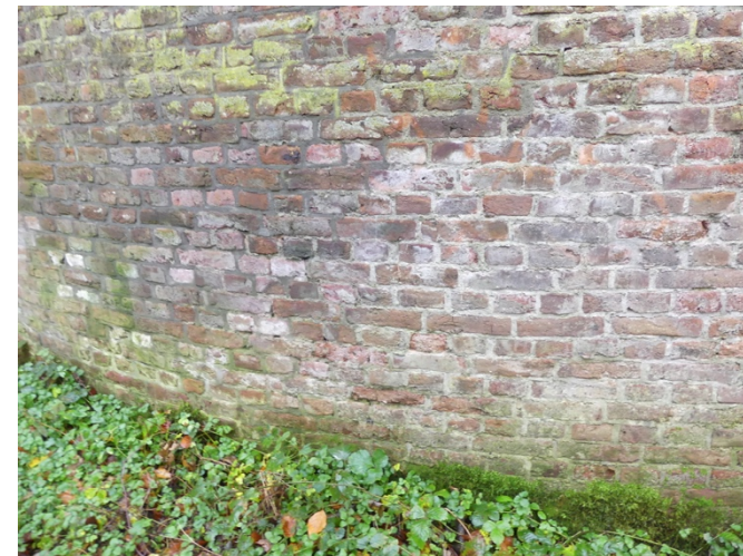
Afb. §22.27, mosgroei bij maaiveld, afwijkend hersteld voegwerk
