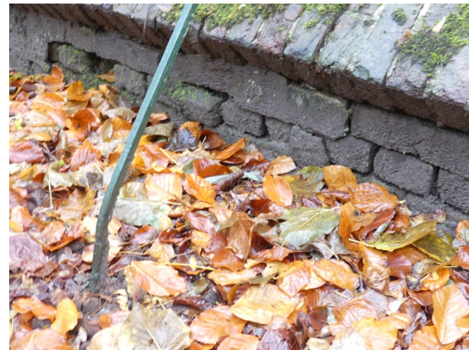
Afb. §22.05, uitgespoeld voegwerk bij maaiveld, afgefallen pleisterwerk, loszittende en uitgevallen stenen
