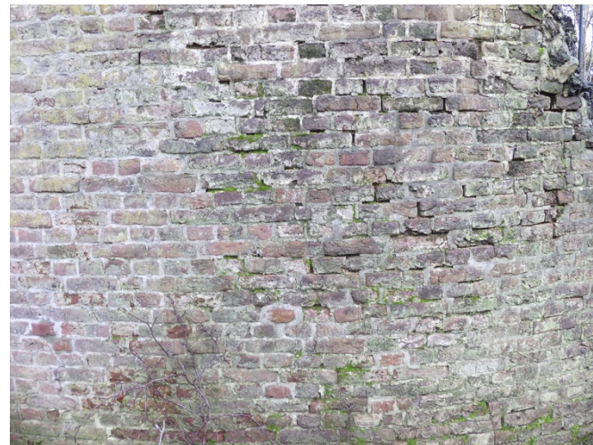
Afb. §22.23, loszittend, uitgevallen voegwerk, kapotte stenen
