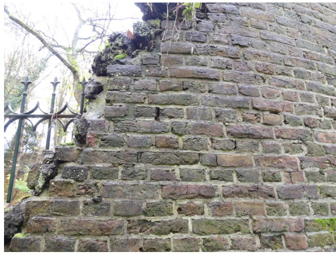
Afb. §22.32, slordig hersteld en weer uitgevallen voegwerk
