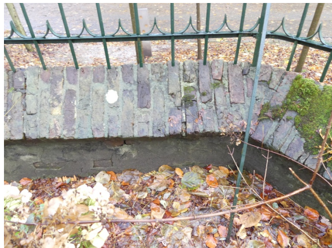
Afb. §22.11, loszittend voegwerk, gescheurde stenen, slordig metselwerk (herstelwerk?), gescheurd pleisterwerk
