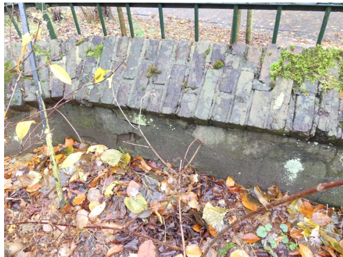
Afb. §22.09, slordig herstelwerk, uitgespoeld voegwerk, gescheurd en loszittend pleisterwerk
