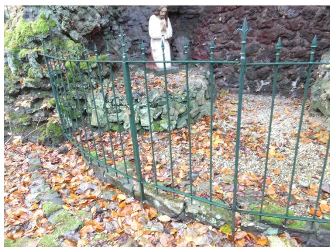
Afb. §43.16, roestvorming op poortje en hangpunten pilaster
