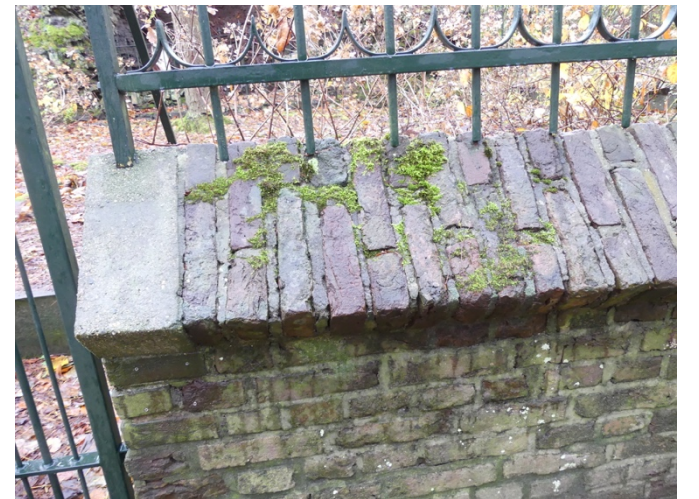
Afb. §22.16, uitgespoeld, losgekrompen voegwerk
