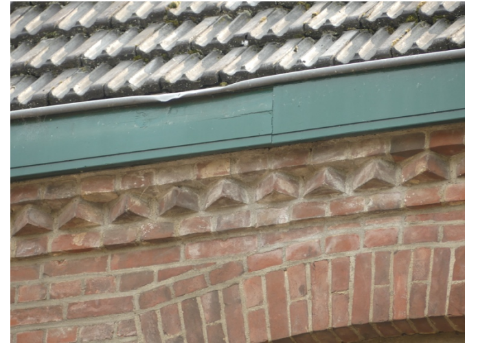
Afb. $50.02, beschadigde, gedeukte dakgoot en gootlijst
