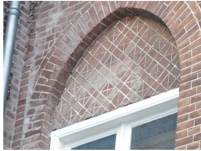
Afb. §22.12, vervuild metselwerk en versleten voegwerk
