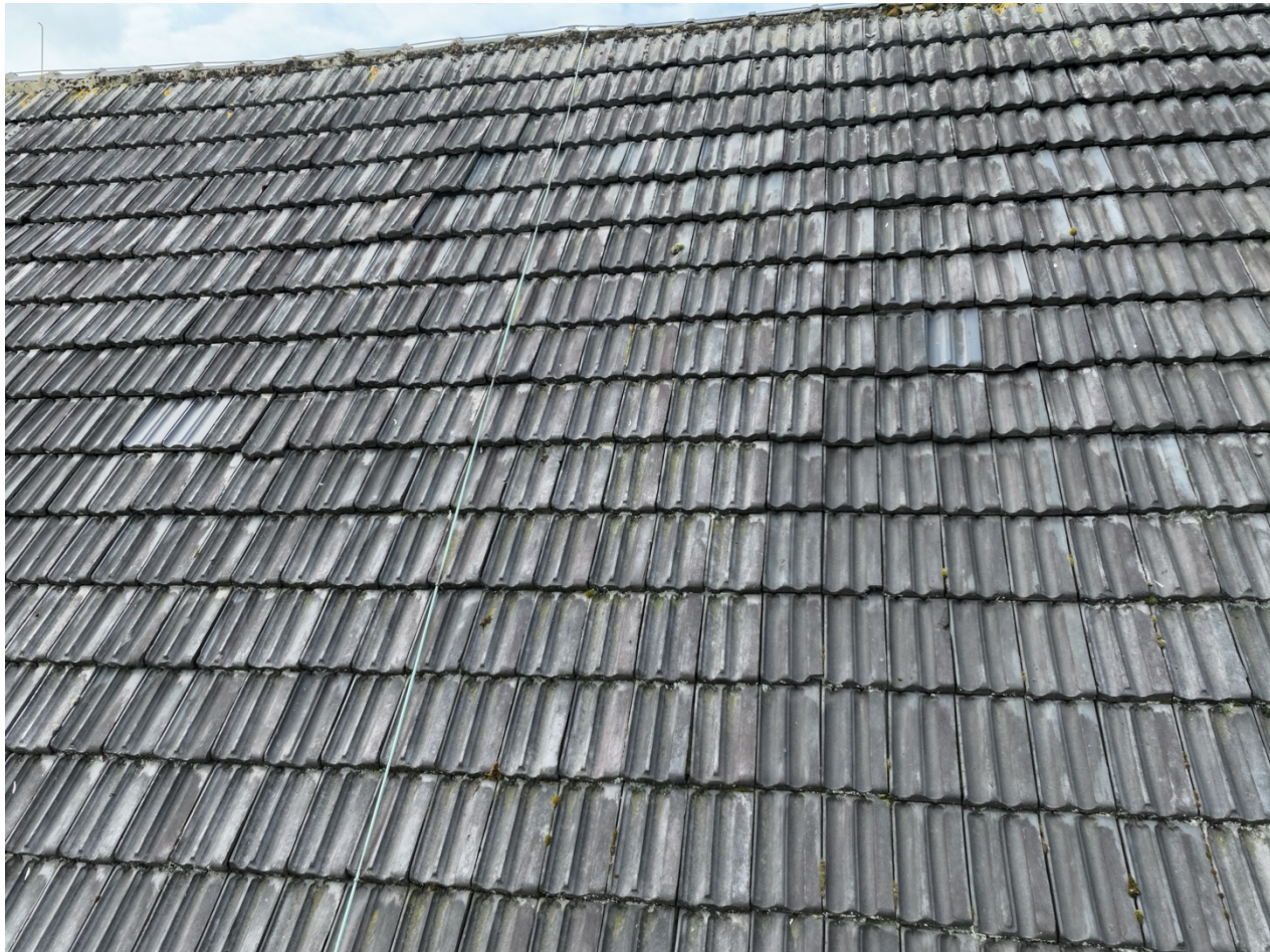
Afb. §33.04, verzakkende, scheefliggende dakpannen
