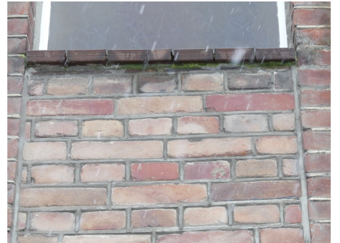
Afb. §22.08, algaanslag en volledig uitgespoeld voegwerk uit raamdorpelstenen
