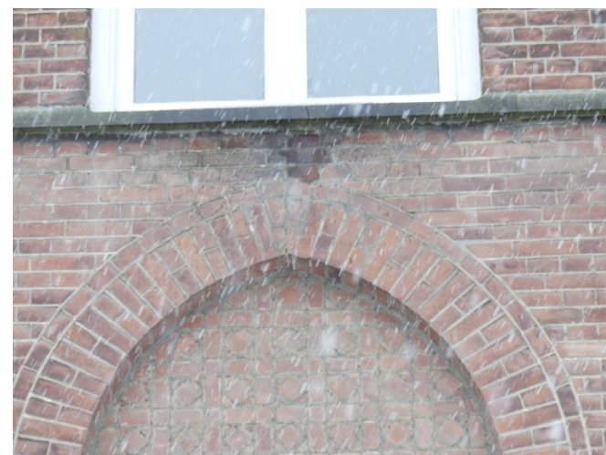
Afb. §35.04, lekkende neerslag onder gescheurde/gebroken raamdorpel
