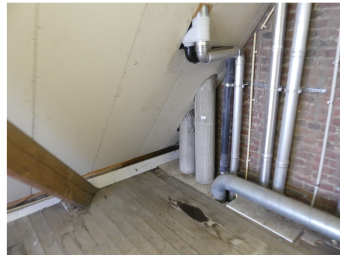
Afb. $60.01, actieve lekkage onder dakdoorvoer
