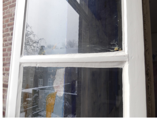
Afb. §34.02, losscheurende stopverf
