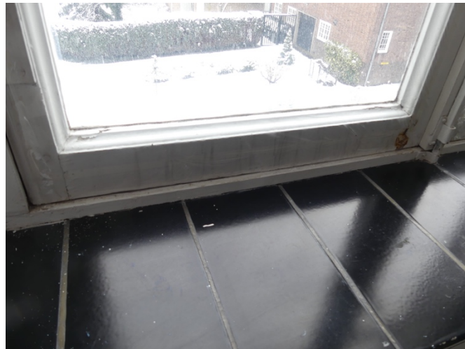
Afb. §46.04, losgebarsten en -gescheurd schilderwerk
