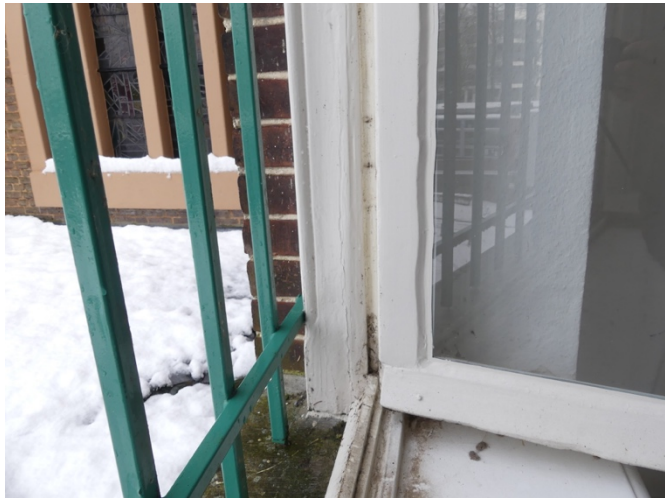
Afb. §46.12, gebarsten schilderwerk op kozijnstijl, slordig bewerkte raamstijl
