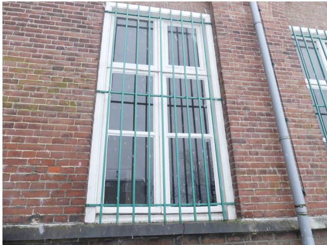
Afb. §22.01, algaanslag, uitgesleten voegwerk en beschadigde bakstenen
