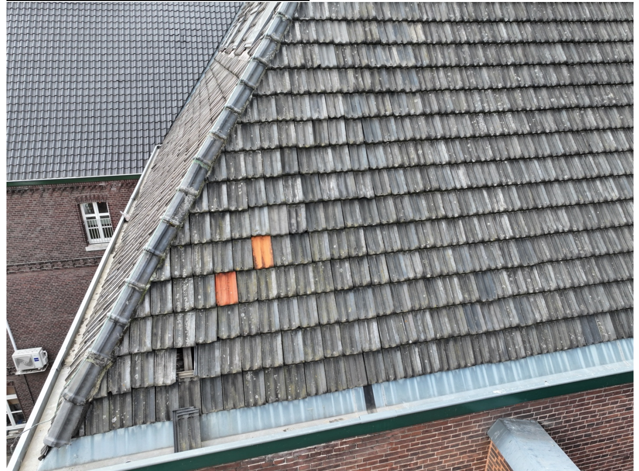
Afb. §33.01, uitgezakte, kapotte en foutief vervangen dakpannen vorsten, uitgevallen en foutief herstelde mortel
