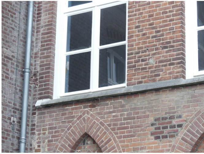
Afb. §22.11, slordige reparaties beschadigd metsel- en voegwerk en uitgesleten voegwerk en beschadigd metselwerk
