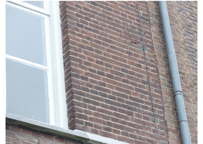
Afb. §22.20, uitgesleten en uitgevallen voegwerk
