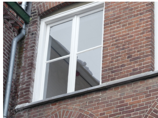
Afb. §22.09, door lekkage vervuild metselwerk
