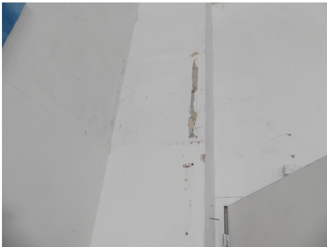
Afb. §46.19, beschadigd, gebarsten sauswerk
