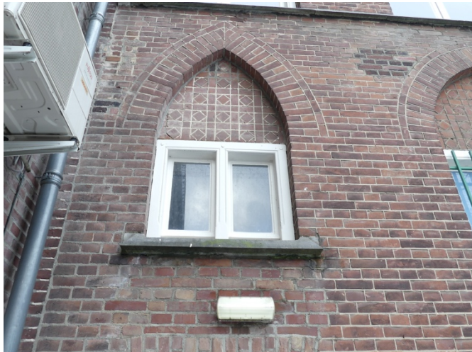
Afb. §22.13, foutief hersteld metselwerk, linksboven boog en en onder waterslag
