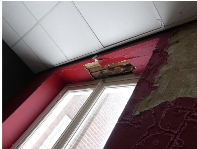
Afb. §45.03, gescheurde en afgefallen betimmering latei
