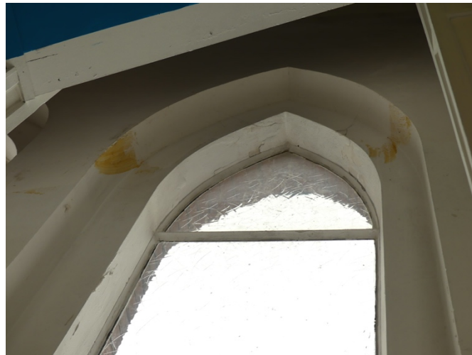
Afb. §40.04, gescheurd en (deels) slordig hersteld pleisterwerk
