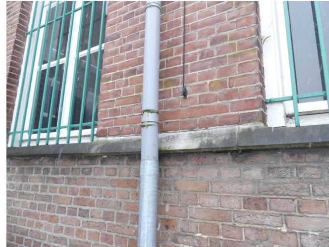
Afb. $50.01, pvc hemelwaterafvoeren met lekkagesporen (verstopping?) boven gietijzeren ondereind
