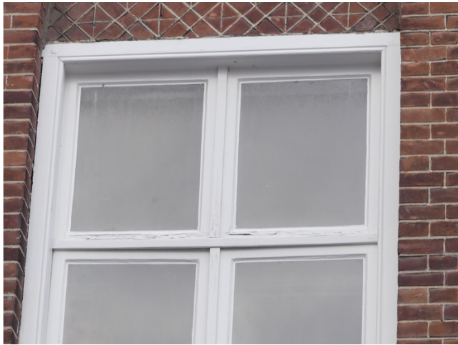
Afb. §46.15, gebarsten schilderwerk op bovenraamdorpel
