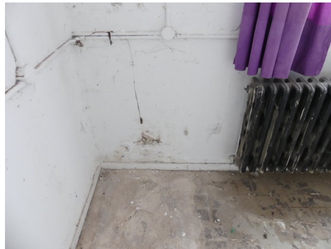
Afb. §46.19, beschadigd, gebarsten sauswerk
