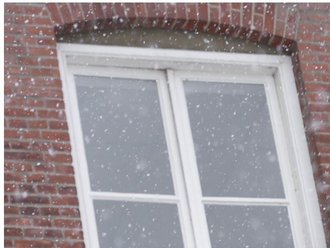
Afb. §30.02, slecht sluitend draairaam (krom getrokken?), slecht schilderwerk
