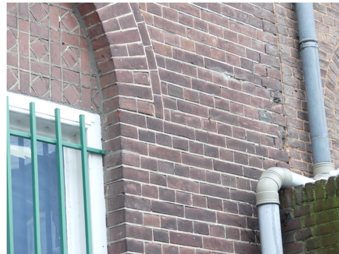
Afb. §22.21, uitgesleten en uitgevallen voegwerk, pvc hwa
