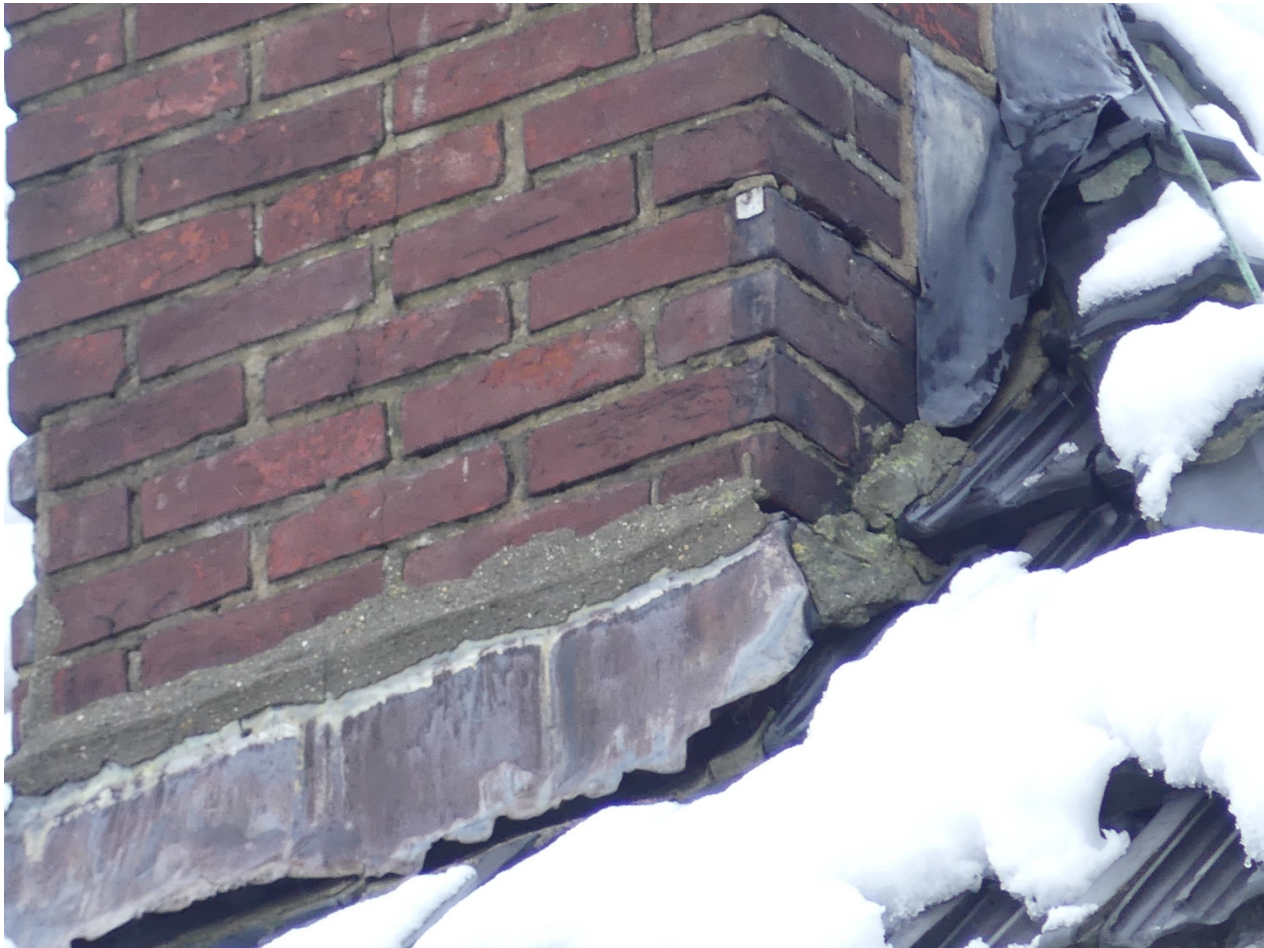
Afb. §33.05, beschadigd metselwerk, uitgevallen voegwerk en opgewaaid, slecht en/of weggevalen loodwerk
