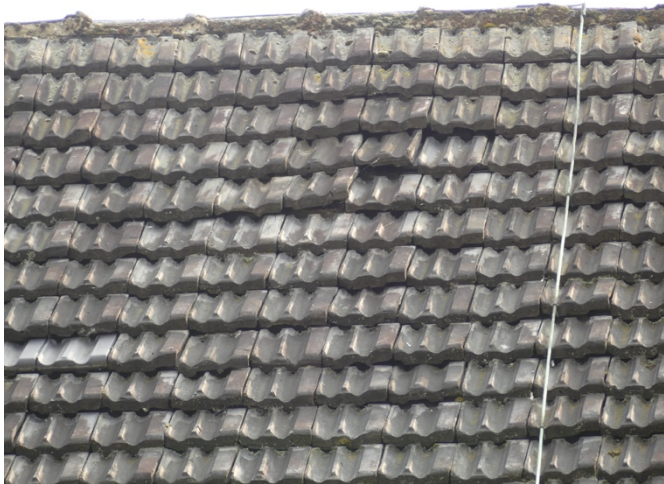
Afb. §33.06, verzakte dakpannen, losgescheurde mortel
