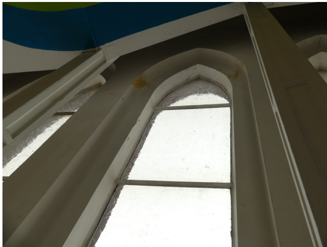
Afb. §40.03, gescheurd en (deels) slordig hersteld pleisterwerk
