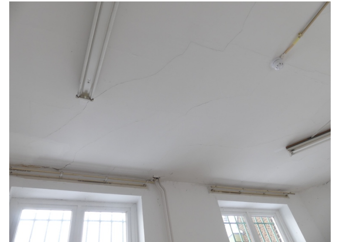
Afb. §40.08 gescheurd plafondpleisterwerk
