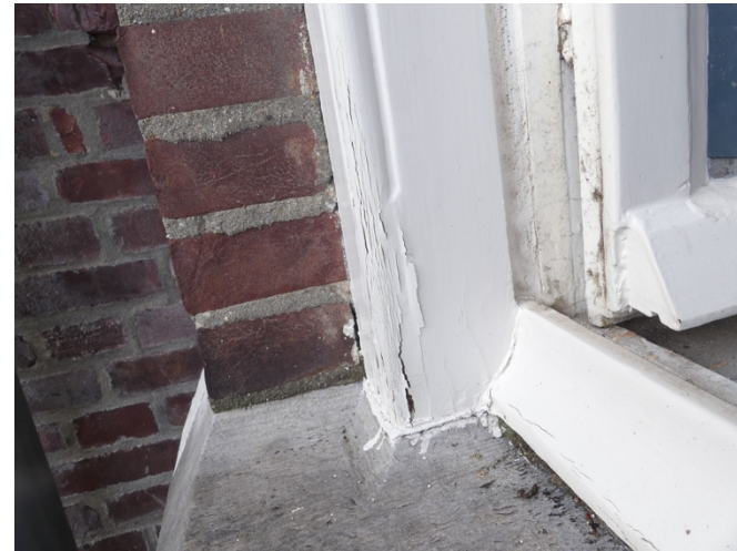
Afb. §46.07, gebarsten schilderwerk op kozijnstijl en -dorpel
