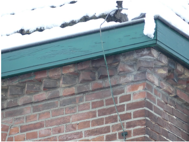
Afb. §46.18, gebarsten schilderwerk op gootlijst
