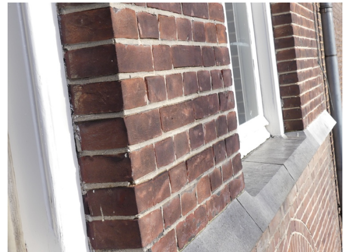
Afb. §22.10, foutief hersteld en uitgesleten voegwerk
