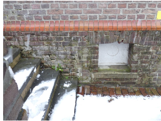
Afb. §22.05, algaanslag, uitgespoeld en foutief hersteld voegwerk en beschadigd metselwerk
