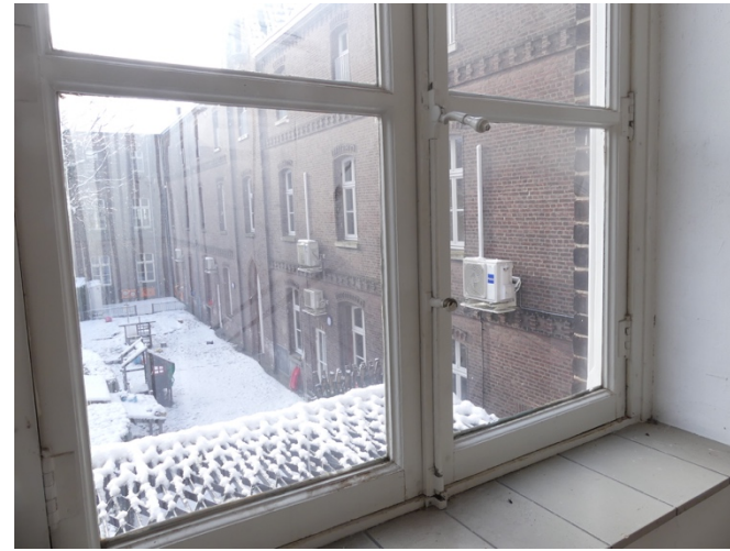
Afb. §46.05, versleten, lekkend, schilderwerk op raamdorpel
