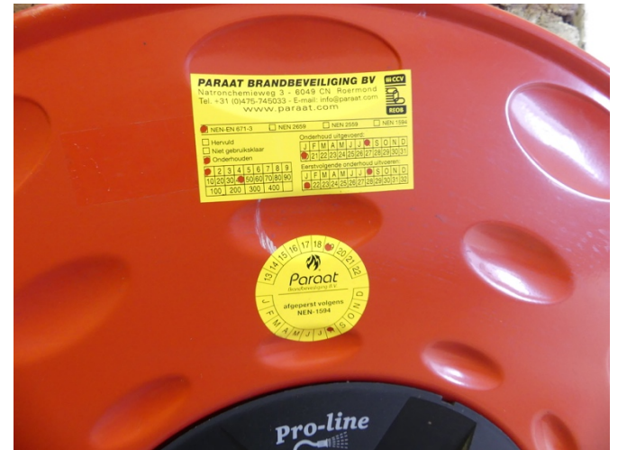
Afb. $54.02, verlopen, niet uitgevoerde keuring en onderhoudsbeurt
