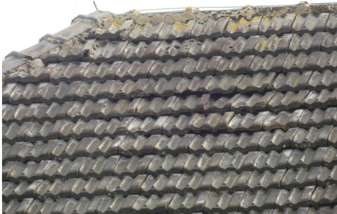
Afb. §33.07, verzakkende dakpannen, losgescheurde mortel
