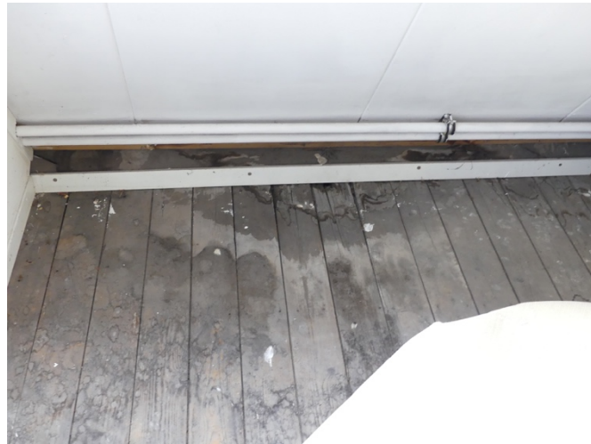
Afb. §24.04, oude (??) lekkagesporen op zoldervloer
