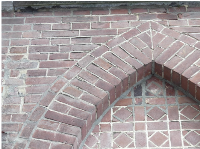
Afb. §22.14, foutief hersteld metsel- en voegwerk en versleten en uitgevallen voegwerk
