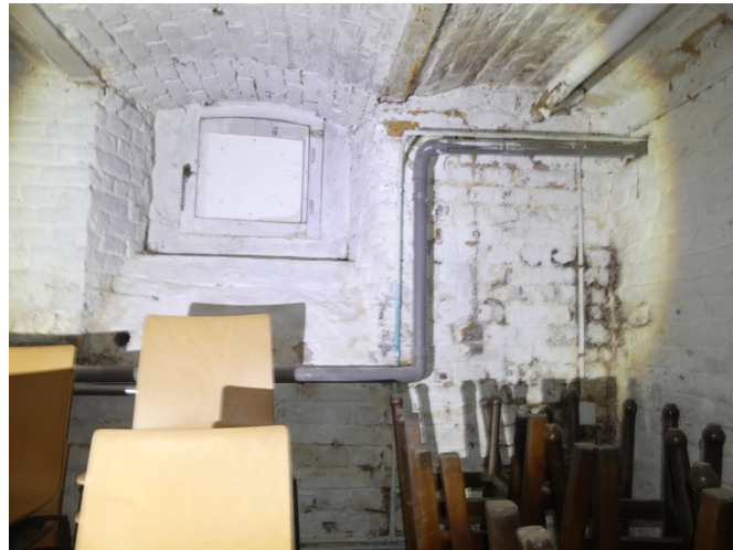
Afb. $46.25, doorslaand vocht kelderwand, roestende liggers
