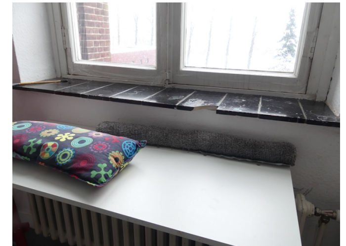
Afb. §22.22, gebroken vensterbanktegel
