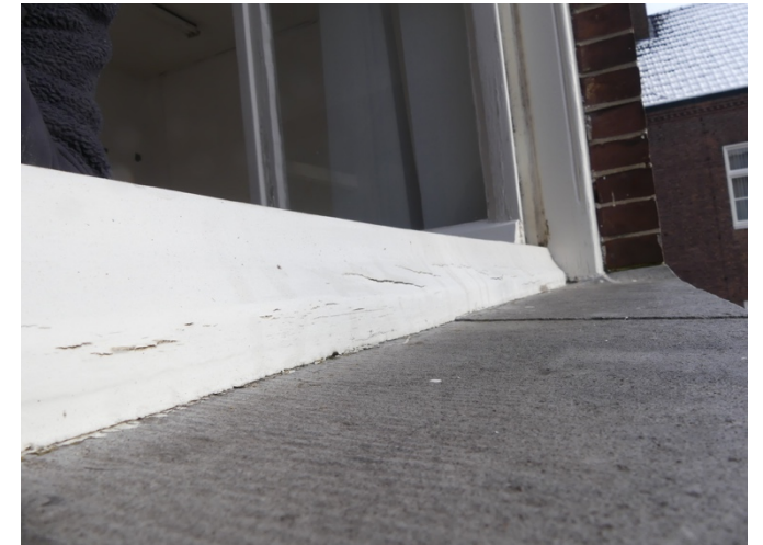
Afb. §46.08, gebarsten schilderwerk op kozijndorpel
