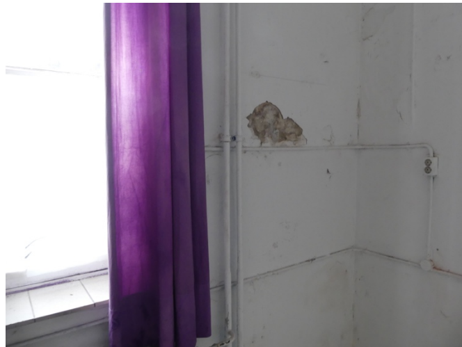
Afb. §40.06, afgevalen pleisterwerk
