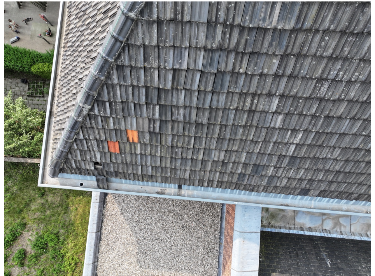
Afb. §33.02, verzakkende, scheefliggende dakpannen
