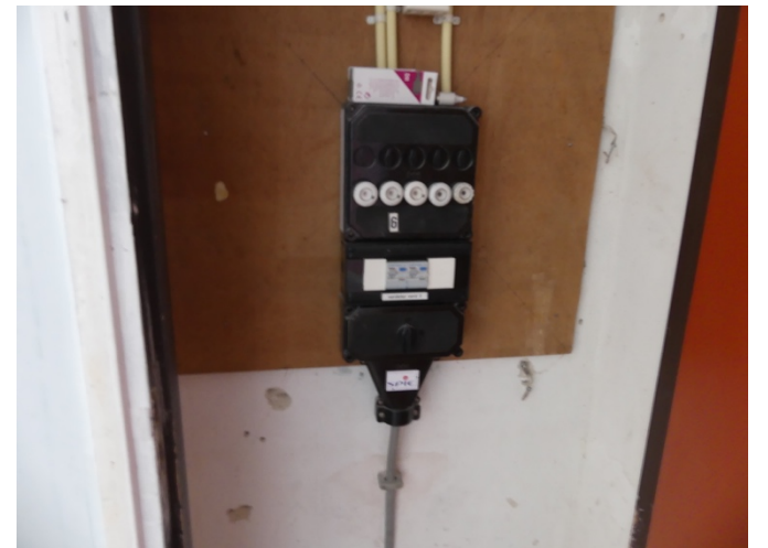
Afb. $70.01, verouderde verdeelkasten E-installatie
