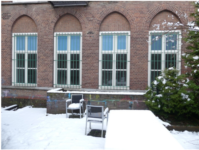
Afb. §46.17, door traliewerk en keldertrap voor schilderwerk lastig bereikbare raamkozijnen
