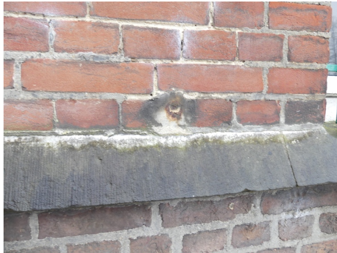
Afb. §22.02, uitgesleten voegwerk en foutief hersteld voegwerk en door roestend ijzer beschadigde bakstenen
