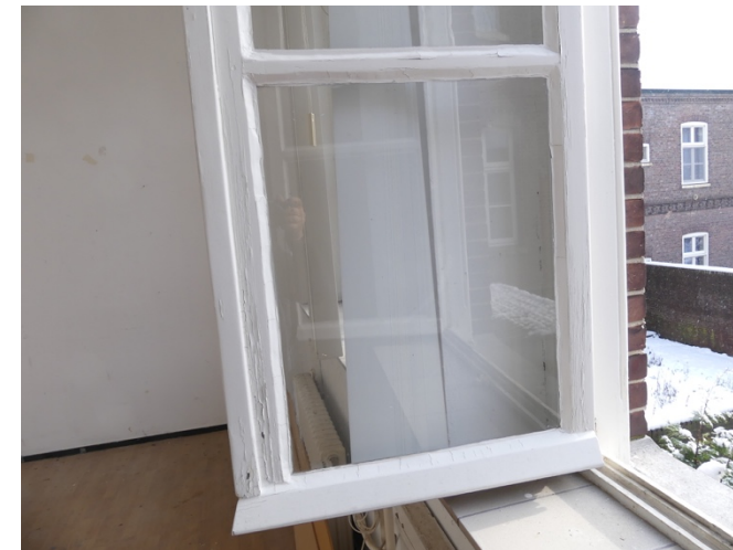
Afb. §46.09, gebarsten schilderwerk op raamstijlen en -roeden
