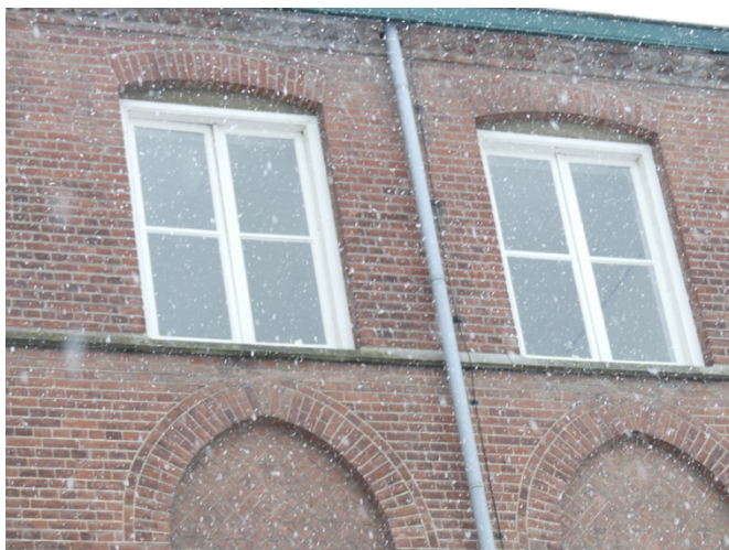
Afb. §30.01, slecht sluitende draairamen
