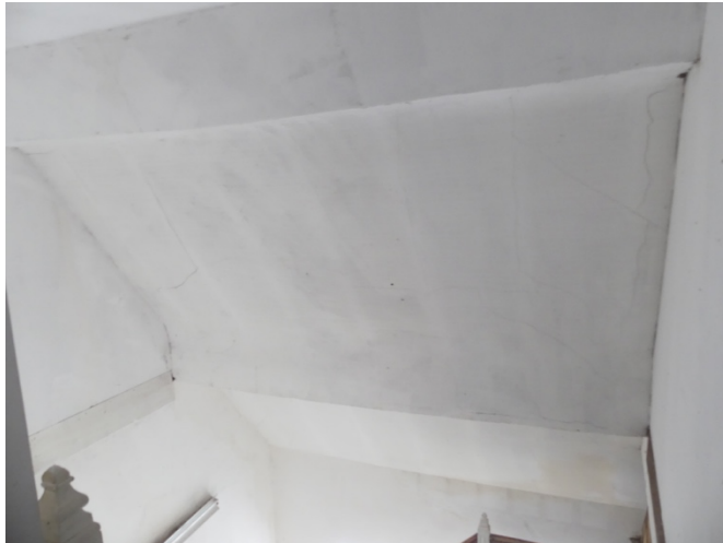
Afb. §40.01, gescheurd pleisterwerk trappenhuis
