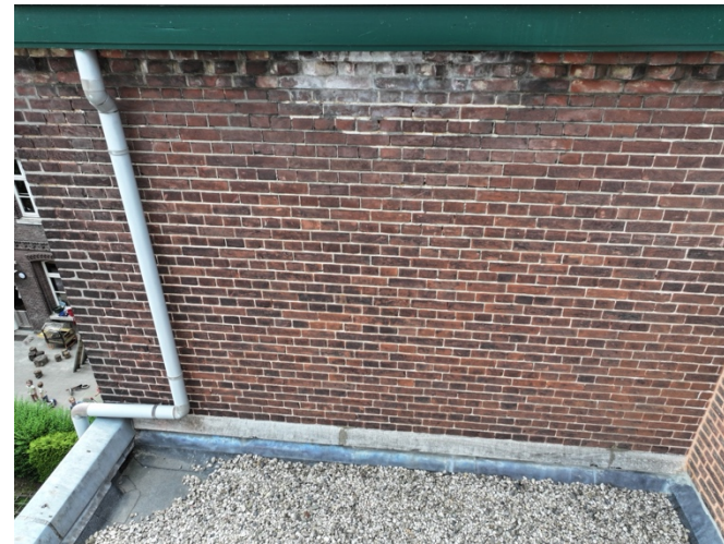
Afb. §22.19, door lekkage vervuild metselwerk, foutief hersteld voegwerk, pvc hwa, slecht lood-, pleister- en gebarsten schilderwerk
