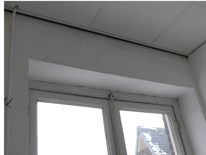
Afb. §40.07, losgescheurd pleisterwerk boven vensteropening
