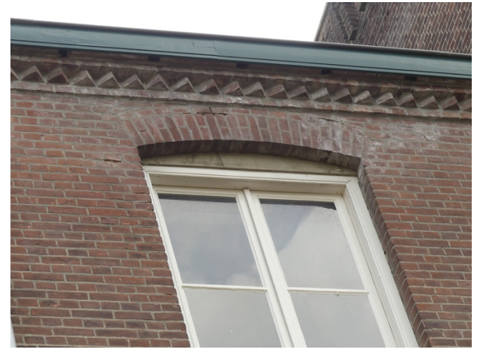
Afb. §22.06, uitgevallen voegwerk, mogelijk losgescheurde boog met bovenliggend metselwerk
