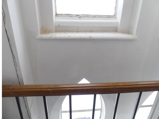
Afb. §40.02, gescheurd en aftekenend (doorbloedend?) pleisterwerk
