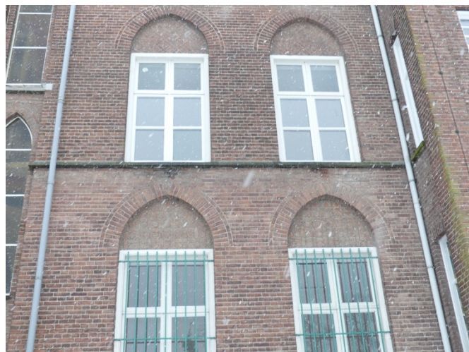
Afb. §35.03, gescheurde/gebroken raamdorpels
