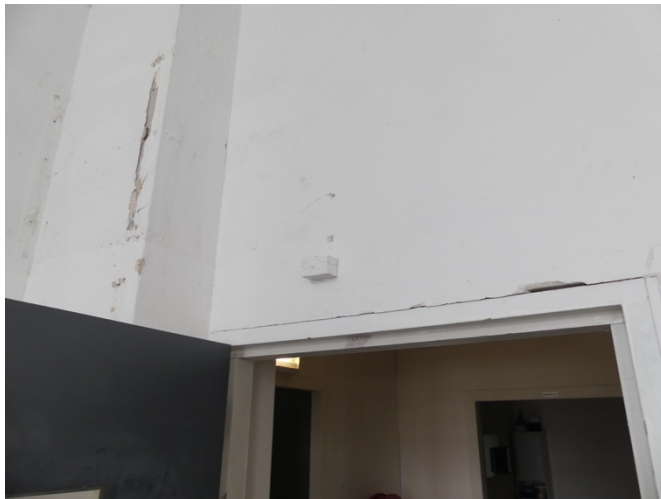
Afb. §40.05, losgescheurd/-zittend pleisterwerk
