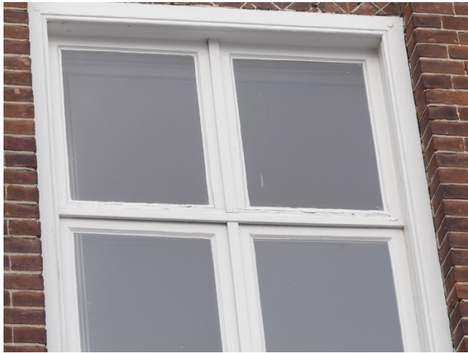
Afb. §46.16, gebarsten schilderwerk op bovenraamdorpel
