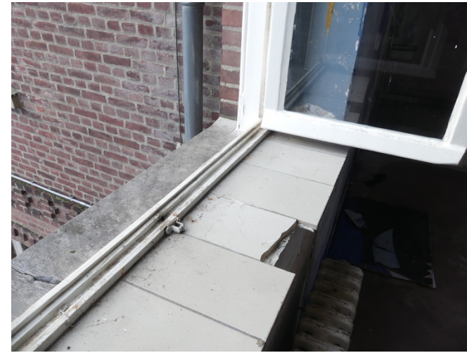
Afb. §35.05, gebroken raamdorpel en vensterbanktegels
