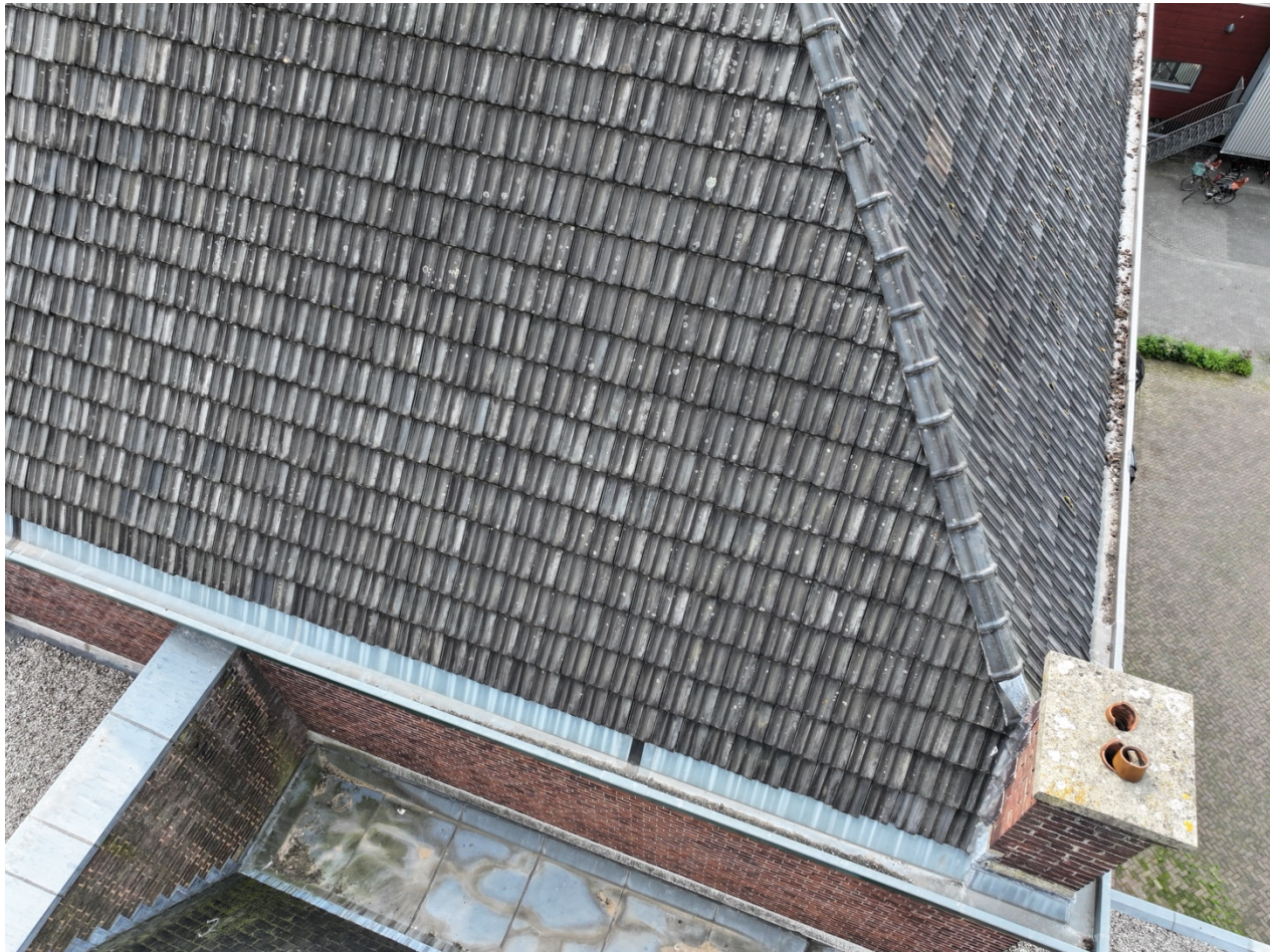
Afb. §33.03, kapotte schoorsteenpotten, uitzakkende dakpannen en bijzonder lood op onderste kepervorst
