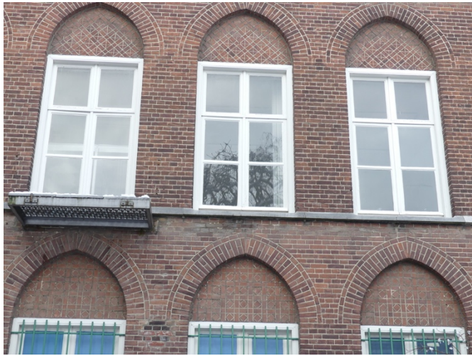
Afb. §46.14, gebarsten schilderwerk op kozijnen en ramen
