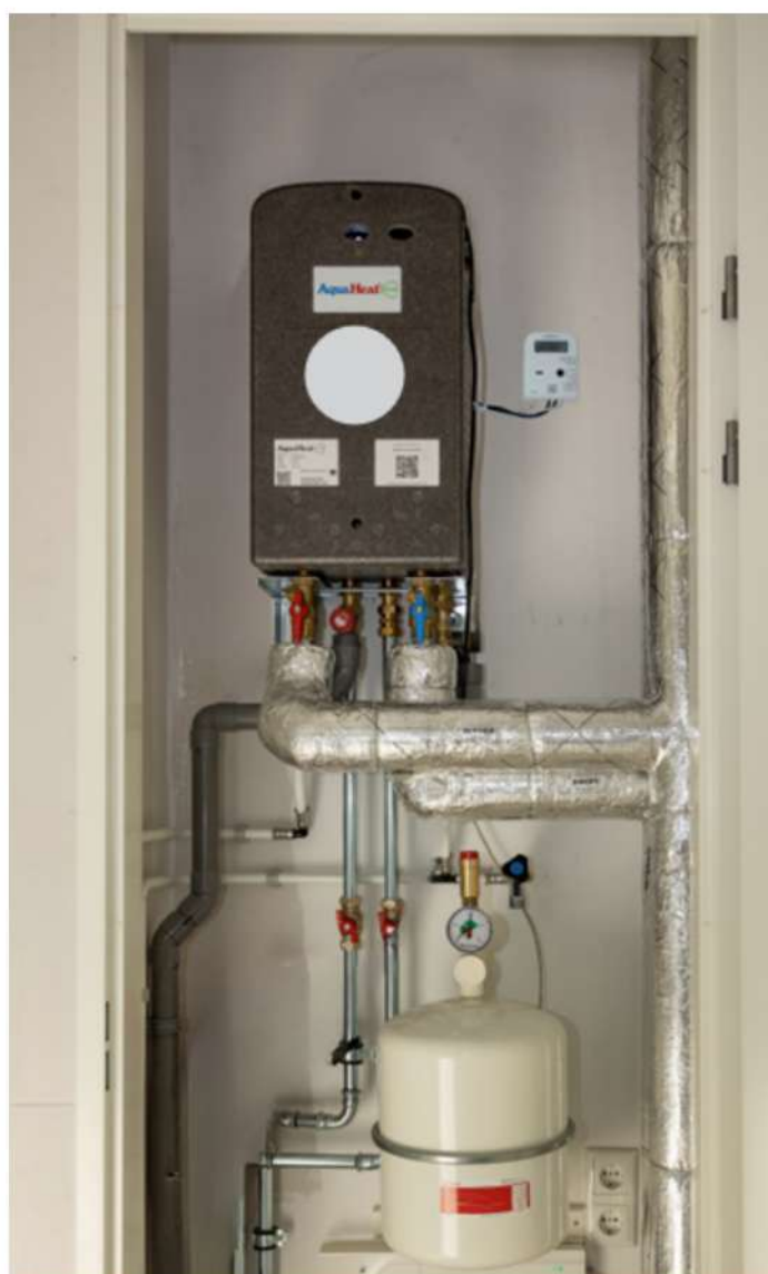
Afleverset in technische ruimte
