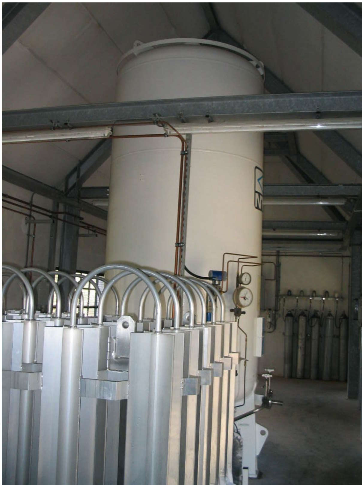
Foto tank huisje Rozema Bouwdeel 28
