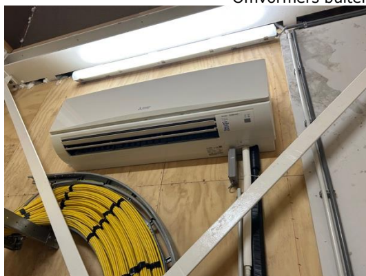
Binnenunit airco serverruimte zolder
