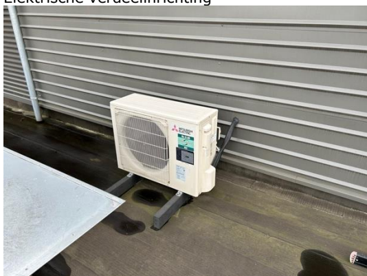
Buitenunit airco serverruimte zolder
