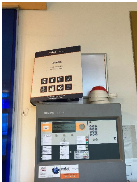
Picture 9: Brandmeldinstallatie en logboek
