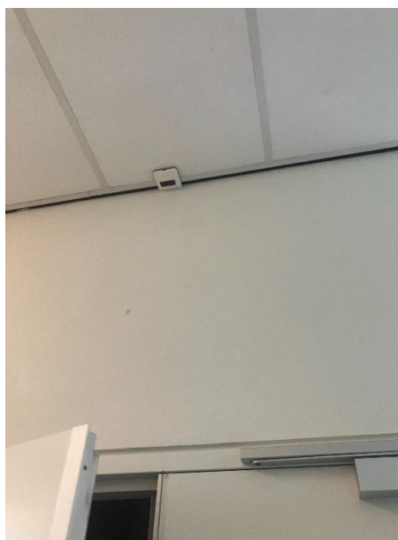
Picture 8: Branddetectie indicator
