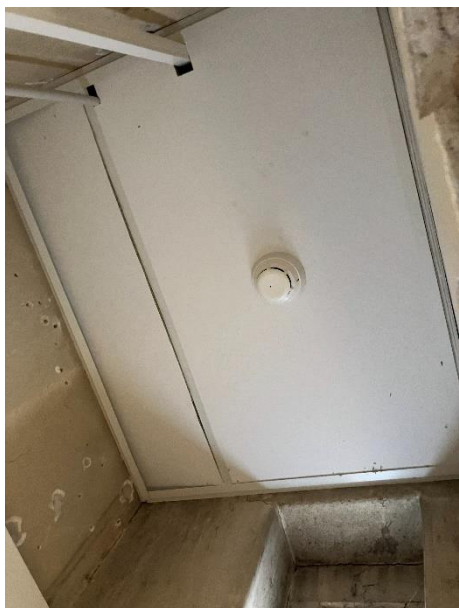
Picture 5: Automatische branddetectie
