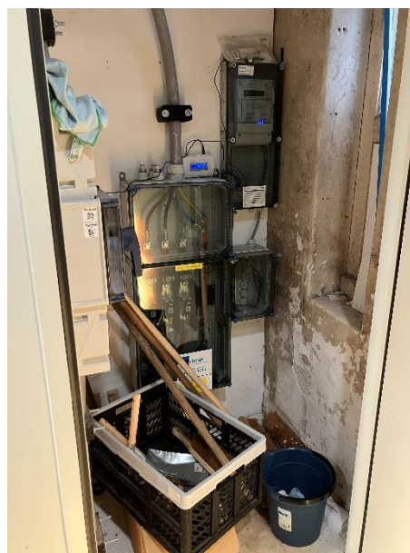
Picture 16: Hoofdelektra aansluiting
