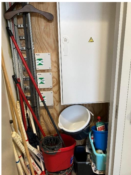
Picture 9: Meterkast opslag
