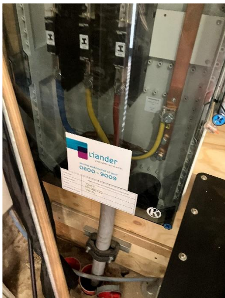
Picture 7: Hoofd elektra aansluiting
