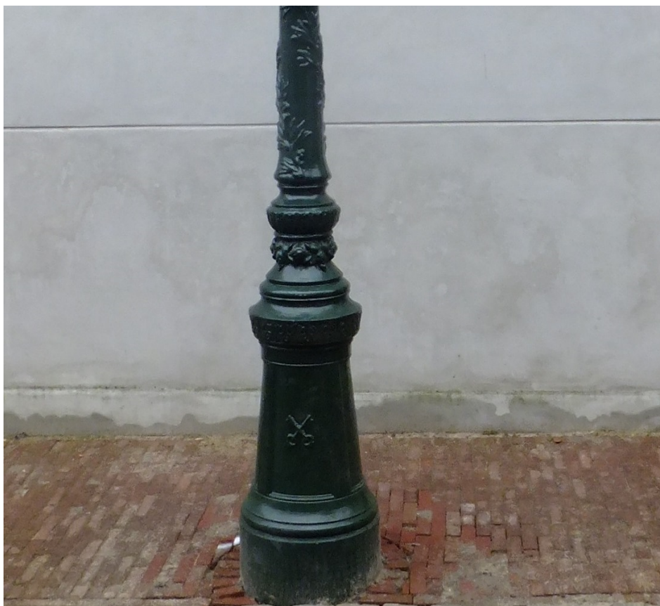
Figuur 2: de gietijzeren lichtmasten type Leiden met de mastdeur haaks op de rijweg plaatsen met de, deuropening van de kant rijweg weg af
