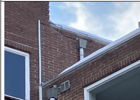
Verzakking aan de buitenzijde, aansluiting bouwdeel 1909 en 1960
