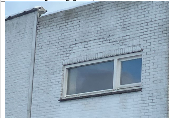
Scheurvorming rollaag, gevel J, bouwdeel 1914
