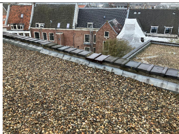
Afdekkers bovenzijde, achterstallig onderhoud
