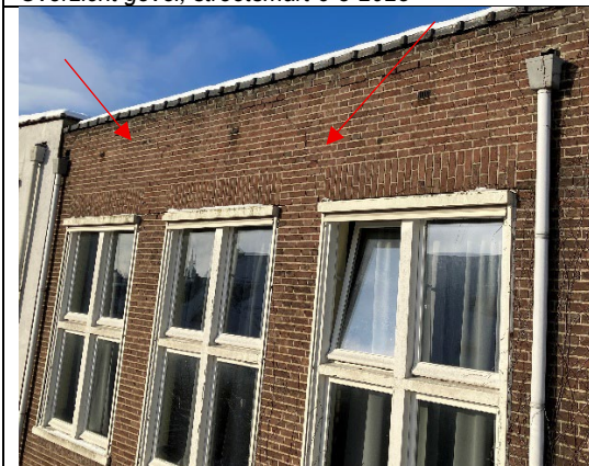
Scheurvorming in de gevel
