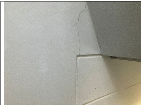
Scheurvorming in gang naar bouwdeel 1960
