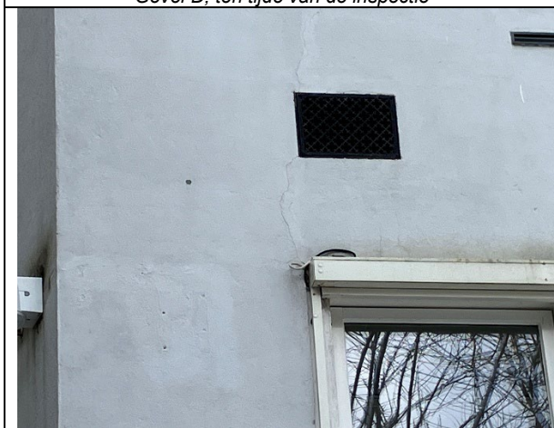
Verticale scheurvorming gevel D
