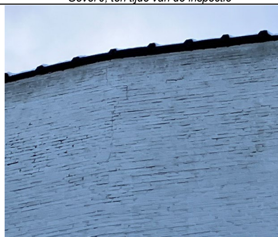
Verticale scheurvorming gevel J
