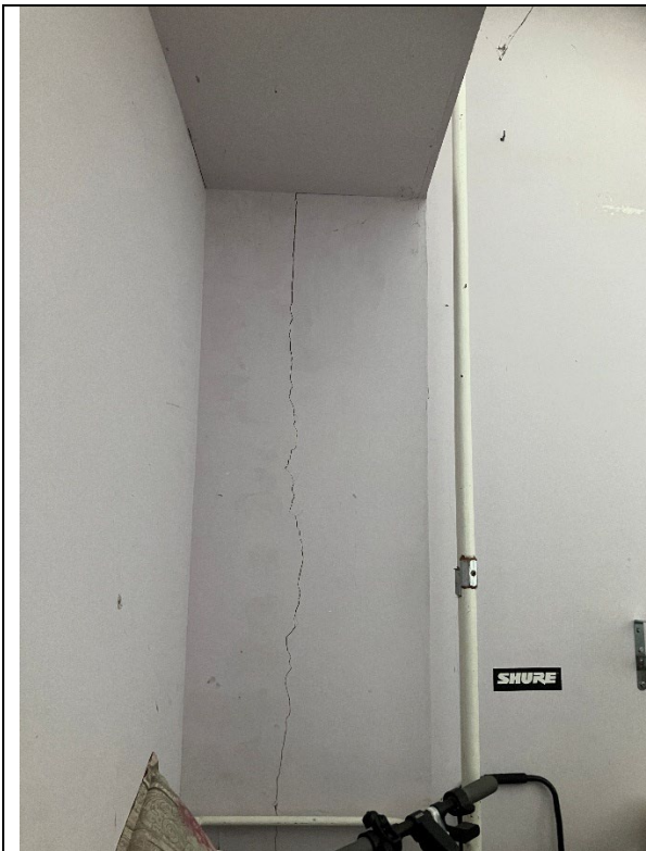
Scheur in penant tussen bouwdeel 1922 en 1967
