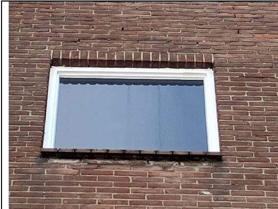
Scheurvorming rollaag, gevel J, bouwdeel 1960
