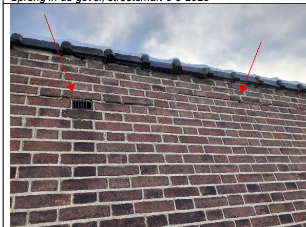
Horizontale scheurvorming tweede verdieping
