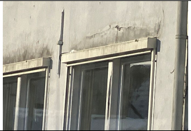
Scheurvorming rollaag, gevel D, bouwdeel 1909
