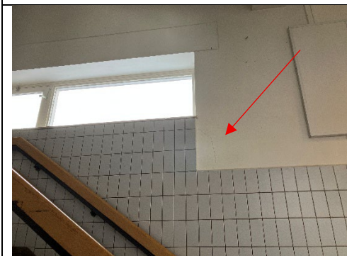
Scheurvorming in het trappenhuis
