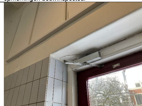
Scheurvorming in het trappenhuis
