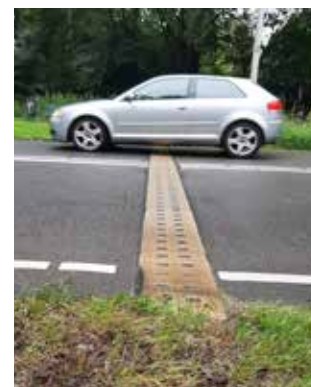
Faunatunnel onder een straat.
