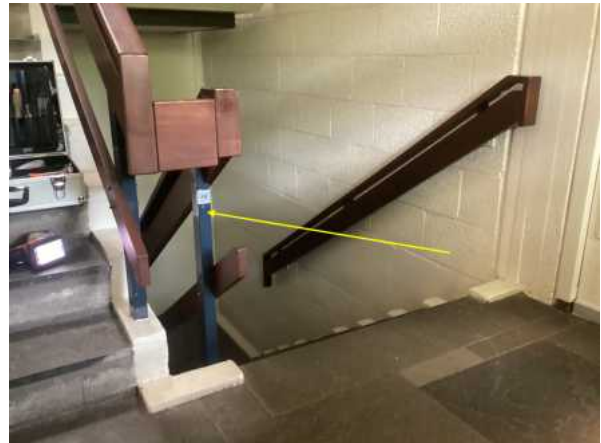
Meetpunt X16 trappenhuis noordkant 1e etage
