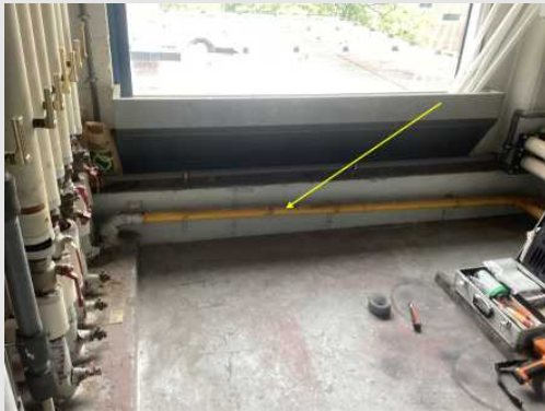
Meetpunt X1 Ketelhuis 2e etage
