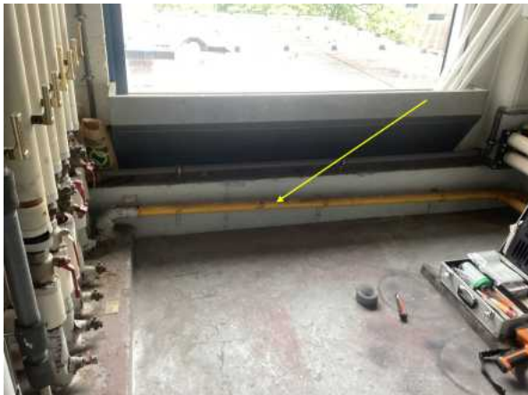
Meetpunt X1 Ketelhuis 2e etage
