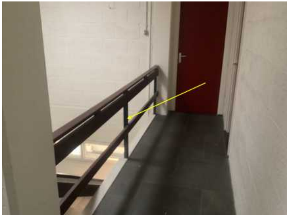
Meetpunt X13 trappenhuis noordkant 2e etage
