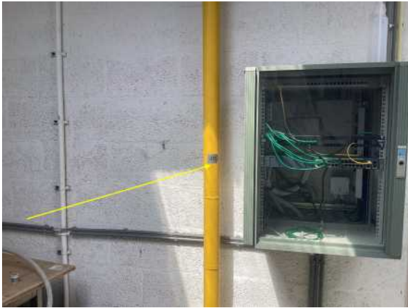
Meetpunt X37 Ketelhuis 1e etage
