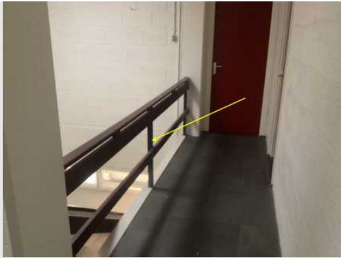
Meetpunt X13 trappenhuis noordkant 2e etage
