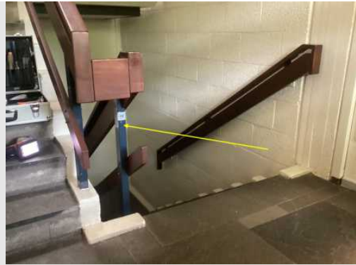
Meetpunt X16 trappenhuis noordkant 1e etage
