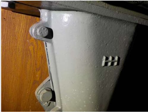
In de flens is een afdichting aanwezig, meestal van asbestkoord
