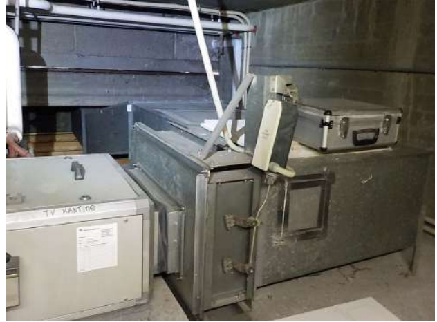
Kruipruimte 020, met kanaaltracé waarin kit gebruikt is
