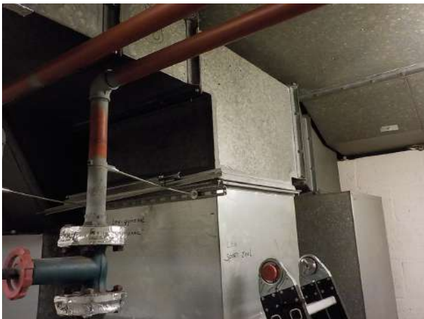
IN RUIMTE 201 ZIJN OOK IDENTIEKE KANALEN MET ASBESTKOORD AANWEZIG. DAARMEE DIENT REKENING TE WORDEN GEHOUDEN BIJ SANERING/WERKZAAMHEDEN IN DEZE RUIMTE
