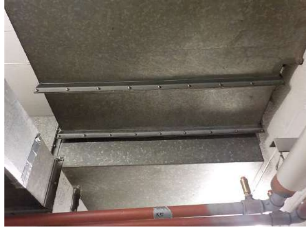
Flenzen van bovenliggend kanaal: voorzien van asbestkoord (6 flenzen)
