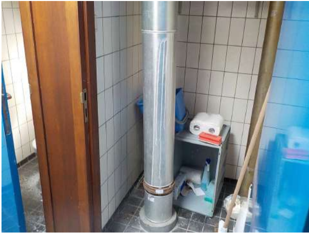
Uitlaat NSA, 1e etage
