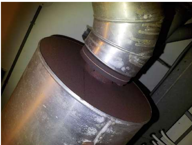
In de NSA ruimte zijn 3 pakkingen aanwezig
