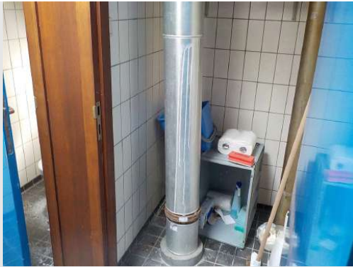
Uitlaat NSA, 1e etage
