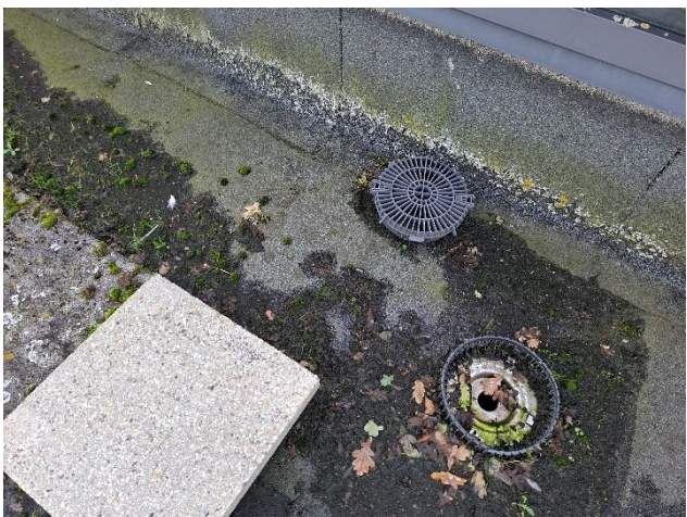
Foto 29 Hemelwaterafvoer UV-onderuitloop in het middengebiet, veel vervuiling aanwezig.
