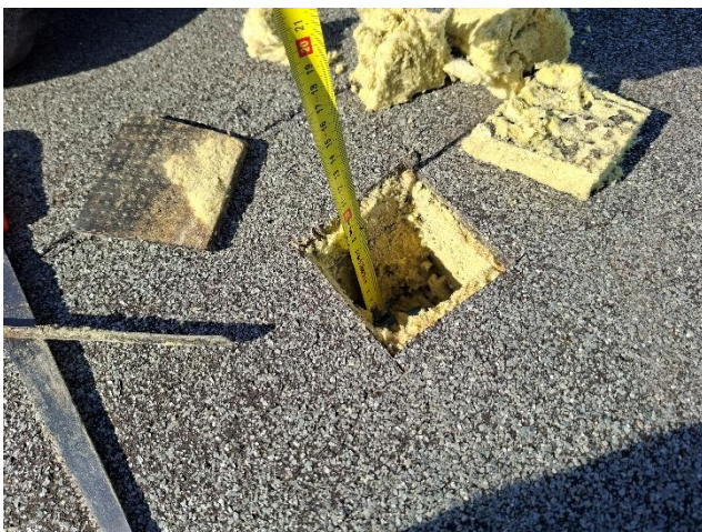
Foto 27 Insnijding 3, ook hier is de samenhang en drukvastheid van de MWR-isolatie volledig verdwenen.
