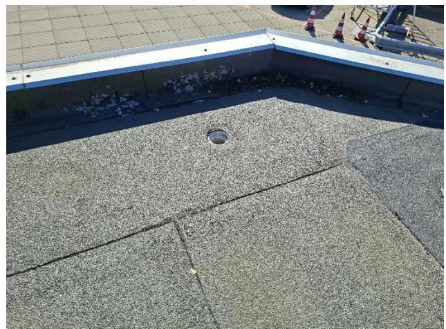
Foto 30 Bij de dakranden zijn traditionele hemelwaterafvoeren aanwezig, deze zijn niet verdiept aangebracht.
