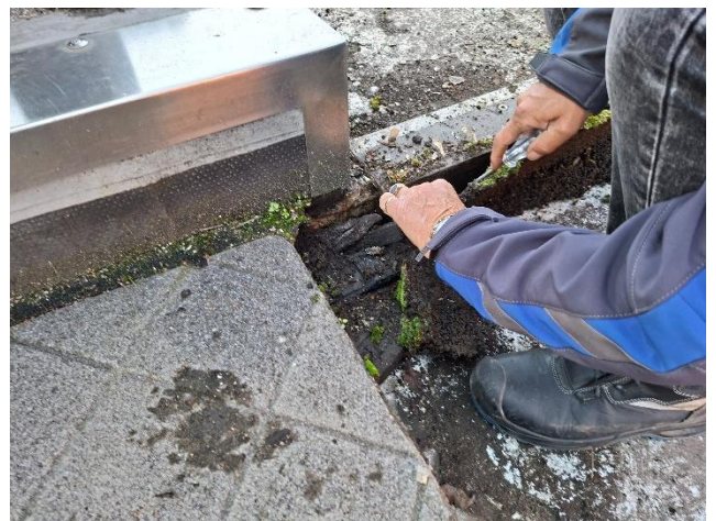
Foto 10 Ook bij de stalen hoeklijn is onthechting aangetroffen.
