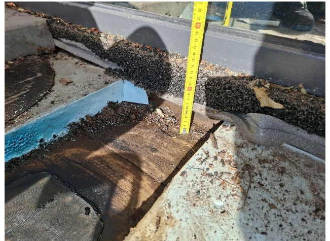
Foto 8 Onvoldoende opstandhoogte bij de vliesgevel.
