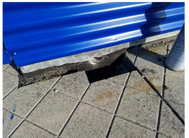
Foto 16 Beperkte opening bij de hemelwaterafvoeren.
