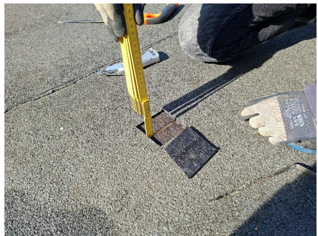
Foto 28 Insnijding 4, geen vocht aangetroffen.
