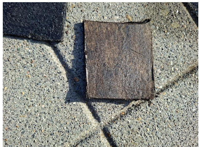
Foto 6 De conditie van de APP-toplaag is redelijk.
