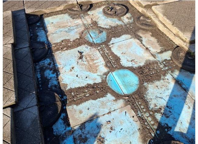
Foto 2 Vervuiling op de XPS-isolatie.
