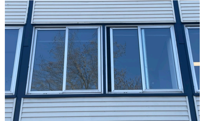
Schuiframen op de verdiepingen in slechte staat, gevel min. geïsoleerd
