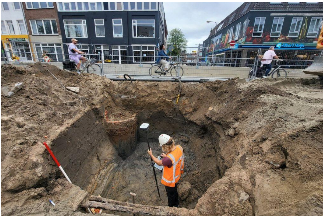
Een oude bakstenen waterput is aangetroffen bij de aanleg van een riool in Utrecht (Bron: Gemeente Utrecht).
