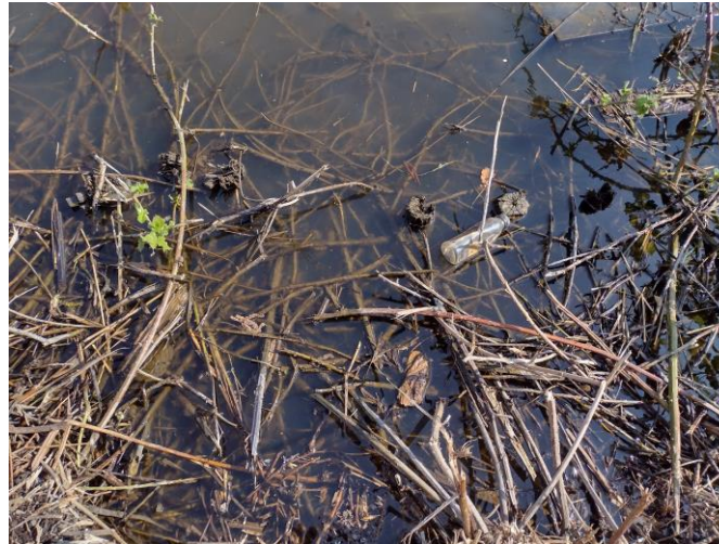
Foto 19: Walbeschoeiing (hout: naast het drijvende flesje zijn houten palen te zien)
